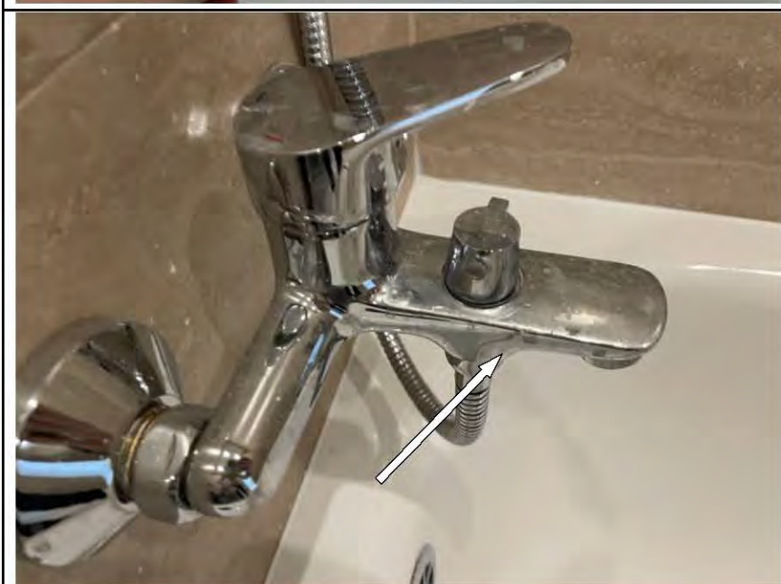
Фото №44. Механическое повреждение на смесителе раковины в ванной комнате.
