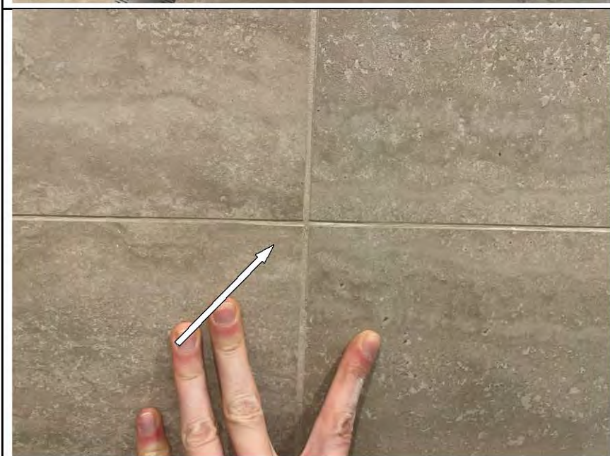
Фото №42. Затирка настенной плитки выполнена с нарушениями в ванной комнате: каверны
