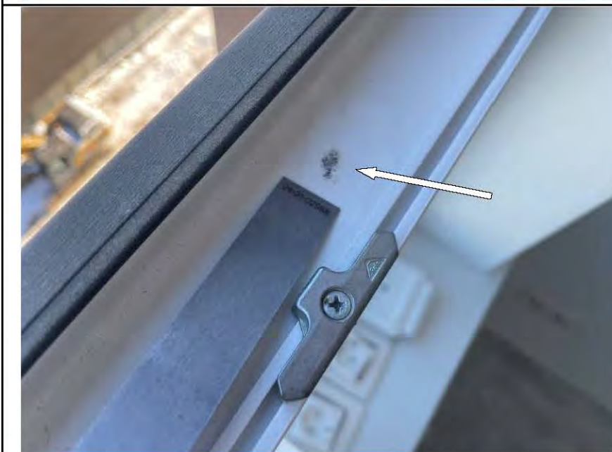
Фото №20. Профиль ПВХ оконного блока в кухне имеет дефекты (стертость).
