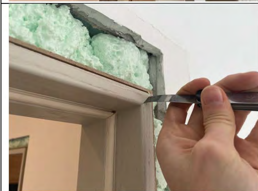
Фото №33. Элементы дверного блока соединены (коробка) не надежно в гостиной
