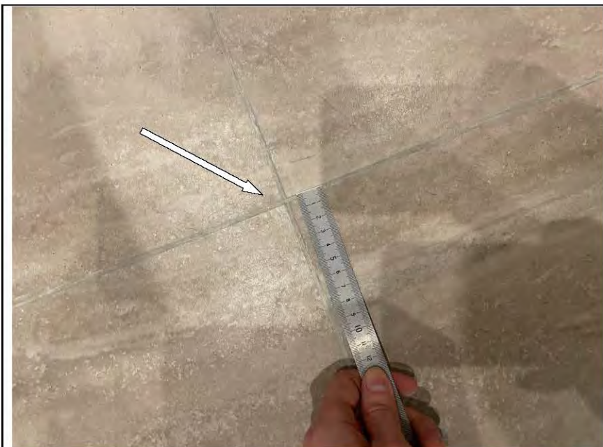
Фото №40. Затирка напольной плитки выполнена с нарушениями в ванной комнате: разность ширины шва
