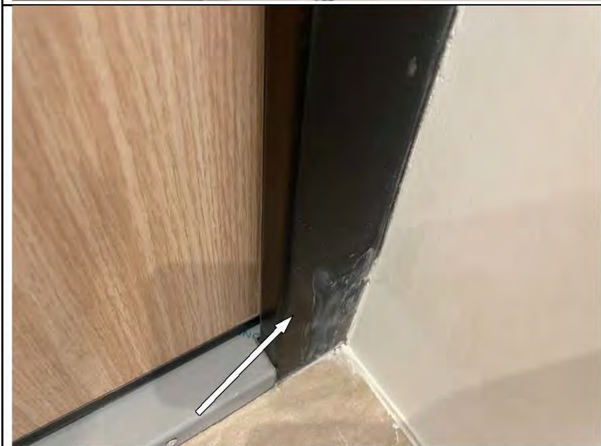
Фото №45. Коробка входного дверного блока имеет дефекты (загрязнение строительными составами)
