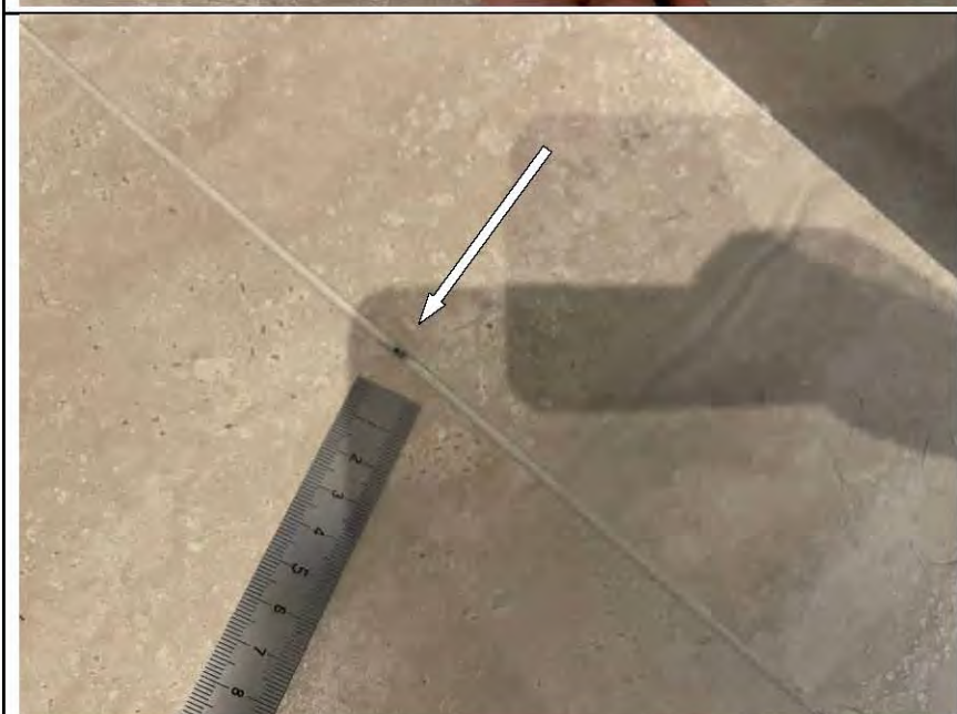
Фото №41. Затирка напольной плитки выполнена с нарушениями в санузле: каверны
