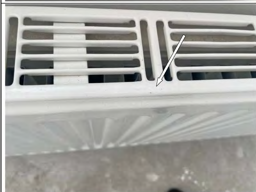
Фото №39. Кожух отопительного прибора в спальне имеет дефект поверхности (скол)
