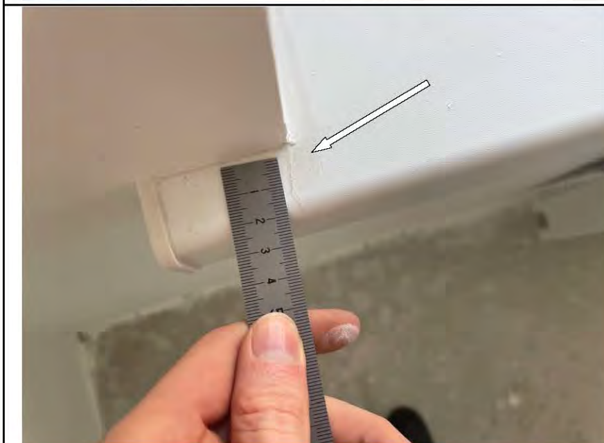
Фото №26. На лицевой поверхности подоконной доски в гостиной имеются дефекты (царапина).
