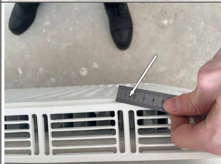
Фото №38. Кожух отопительного прибора в гостиной имеет дефект поверхности (царапина)
