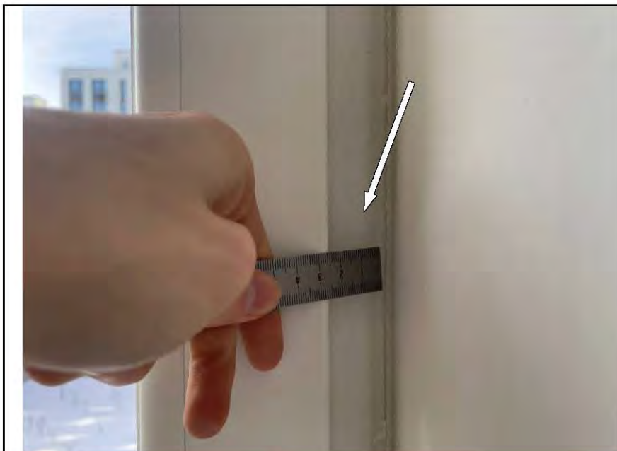
Фото №25. Профиль ПВХ оконного блока в спальне имеет дефекты (царапина).
