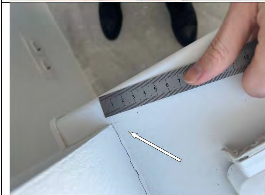
Фото №27. На лицевой поверхности подоконной доски в кухне имеются дефекты (царапина).
