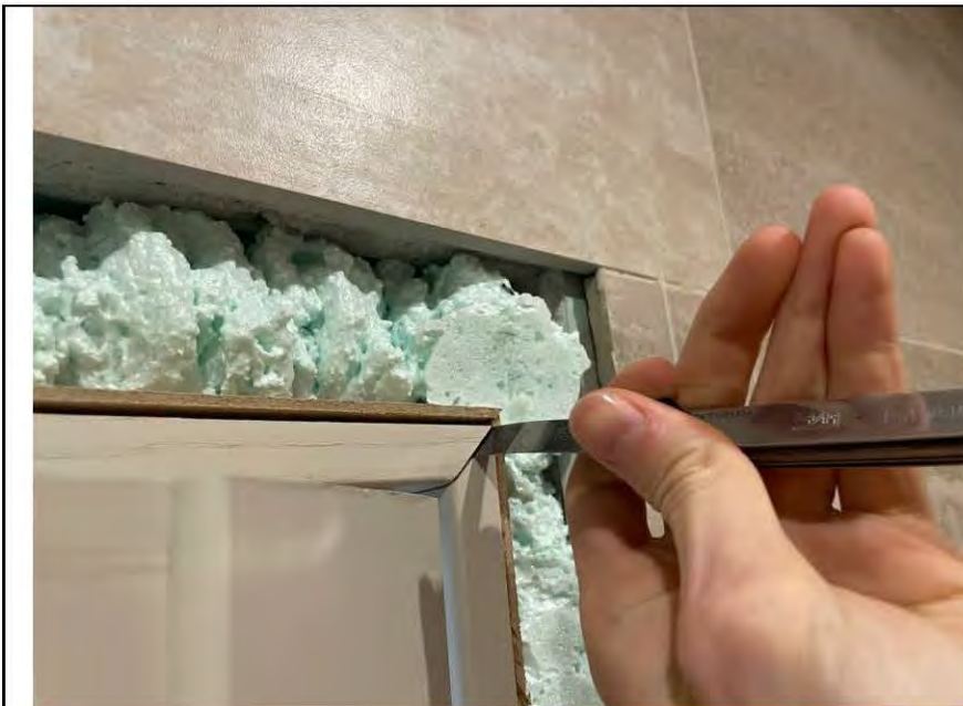
Фото №31. Элементы дверного блока соединены (коробка) не надежно в санузле
