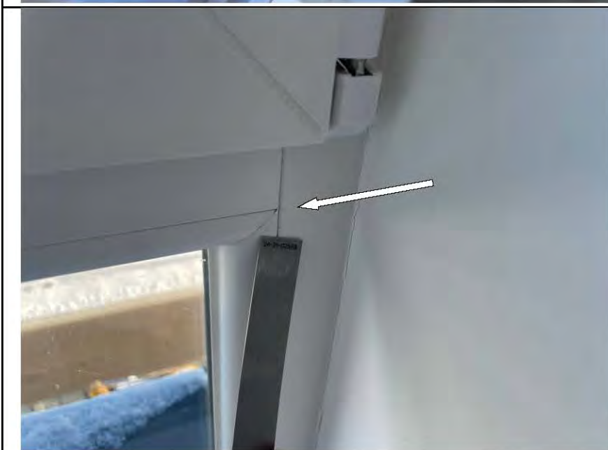
Фото №21. Профиль ПВХ оконного блока в кухне имеет дефекты (царапина).
