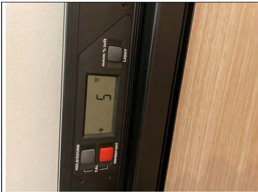
Фото №46. Отклонение коробки входного дверного блока составляет 5 мм
