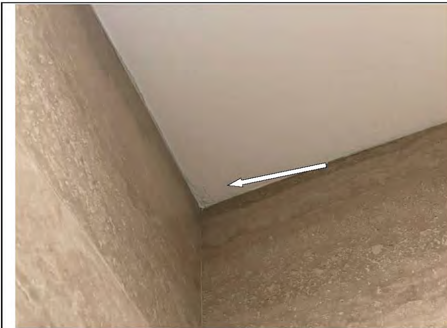
Фото №37. Окрашенный потолок в санузле выполнен с дефектами (отлупы)
