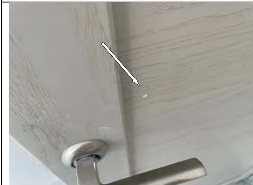
Фото №35. Дефекты (загрязнение малярными составами) на лицевой поверхности полотна деревянного дверного блока в ванной комнате
