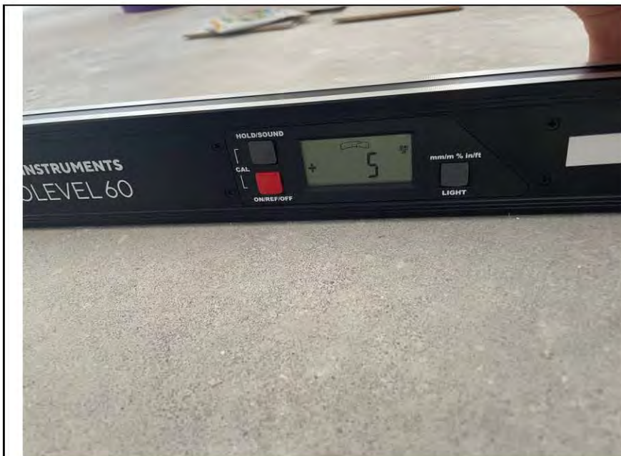
Фото №13. Измерения уровня напольного покрытия в кухне (ЦПС стяжка).
