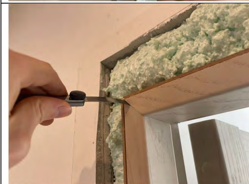
Фото №32. Элементы дверного блока соединены (коробка) не надежно в спальне
