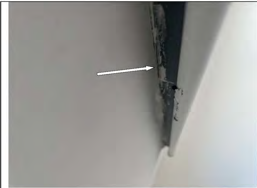
Фото №28. Отверстие под подоконником не загерметизировано в кухне
