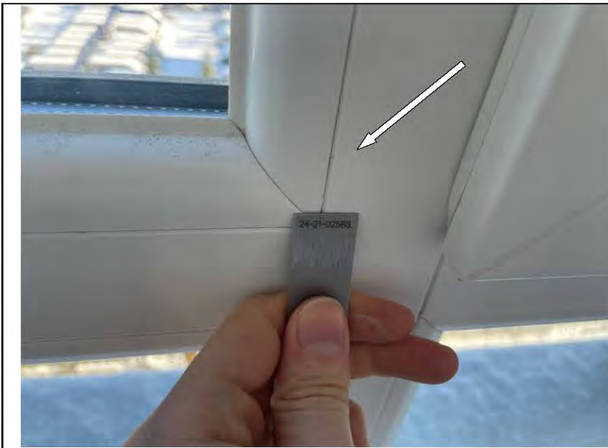
Фото №19. Профиль ПВХ оконного блока в кухне имеет дефекты (сколы).
