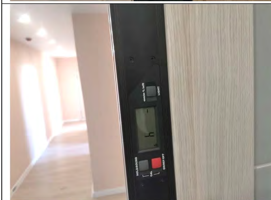
Фото №42. Отклонение коробки дверного блока в санузле.
