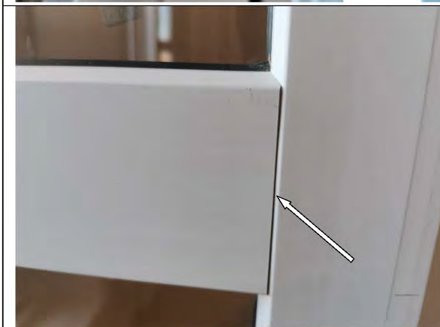
Фото №53. Зазор в профиле дверного блока ПВХ в гостиной.
