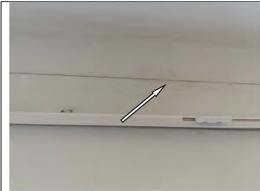
Фото №64. Загрязнение оконного профиля монтажным составом в кухне.
