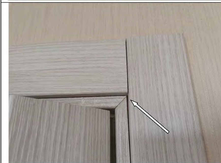
Фото №45. Дверной блок на кухне смонтирован не надежно.
