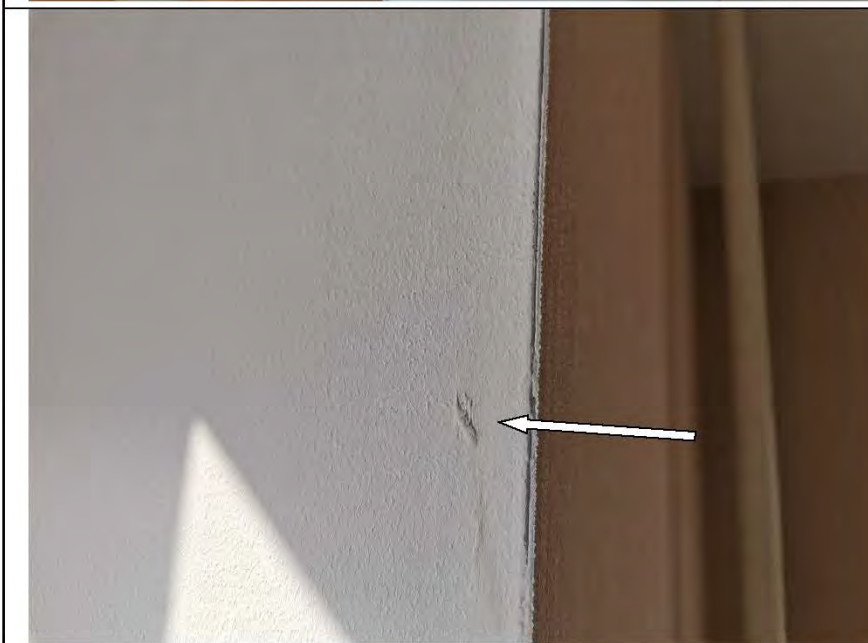
Фото №59. Дефект окрасочного слоя откосов в спальне.
