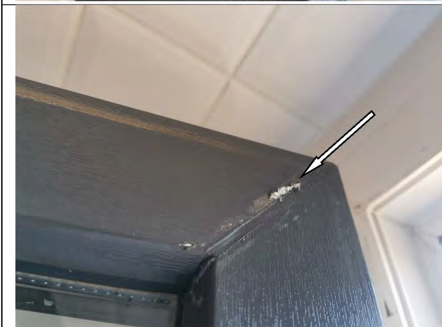
Фото №75. Скол профиля оконного блока в ванной комнате.
