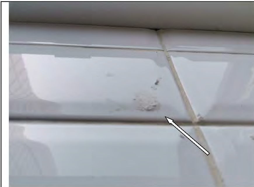
Фото №19. Загрязнение настенной керамической плитки в ванной комнате.
