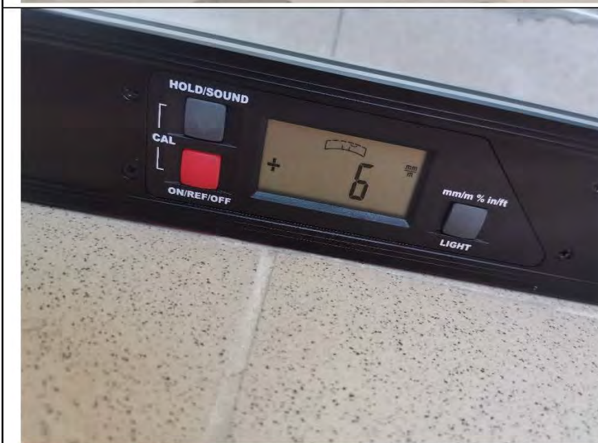
Фото №26. Отклонение напольного покрытия из керамической плитки по горизонтали в лоджии.
