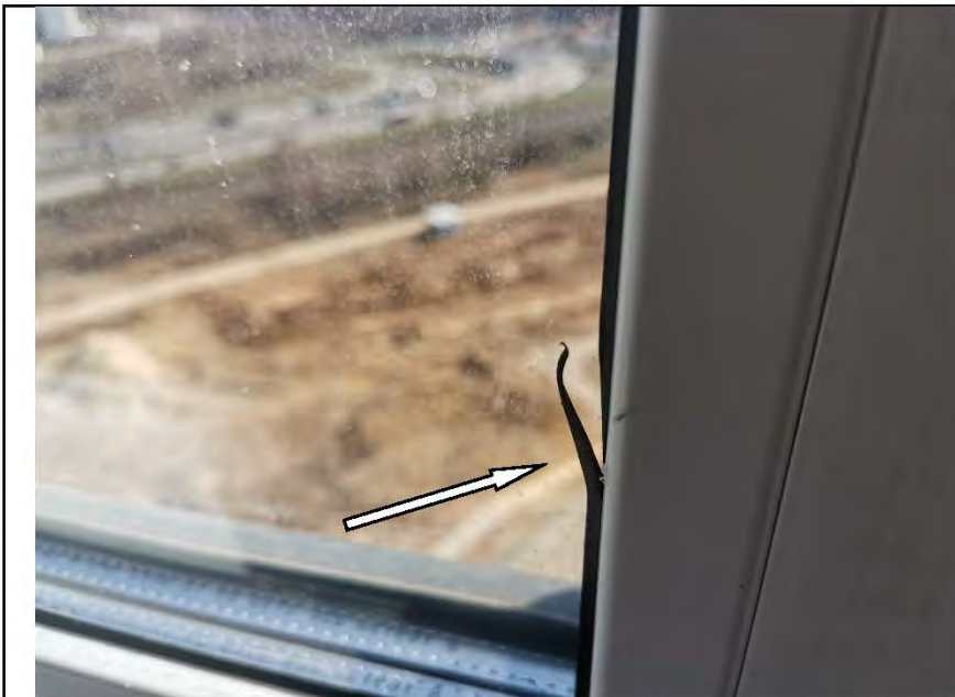
Фото №79. Дефект монтажа уплотнительной резинки оконного блока в спальне.
