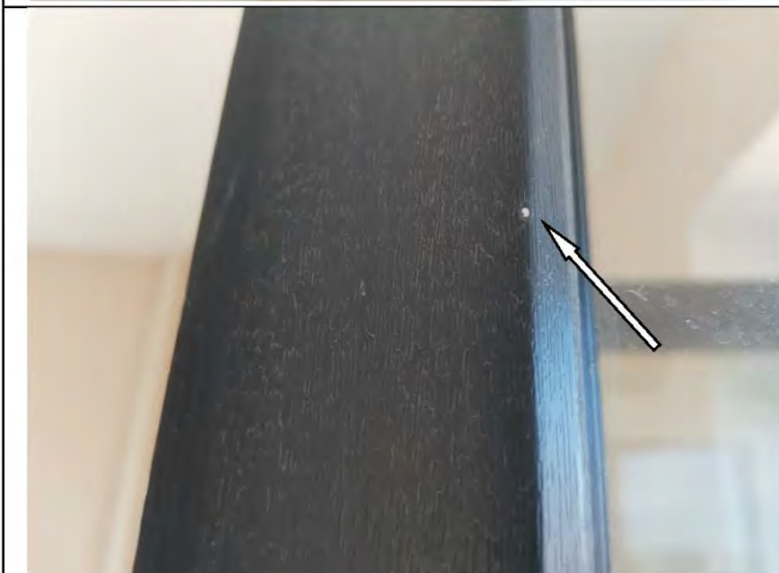
Фото №74. Скол профиля оконного блока в спальне.
