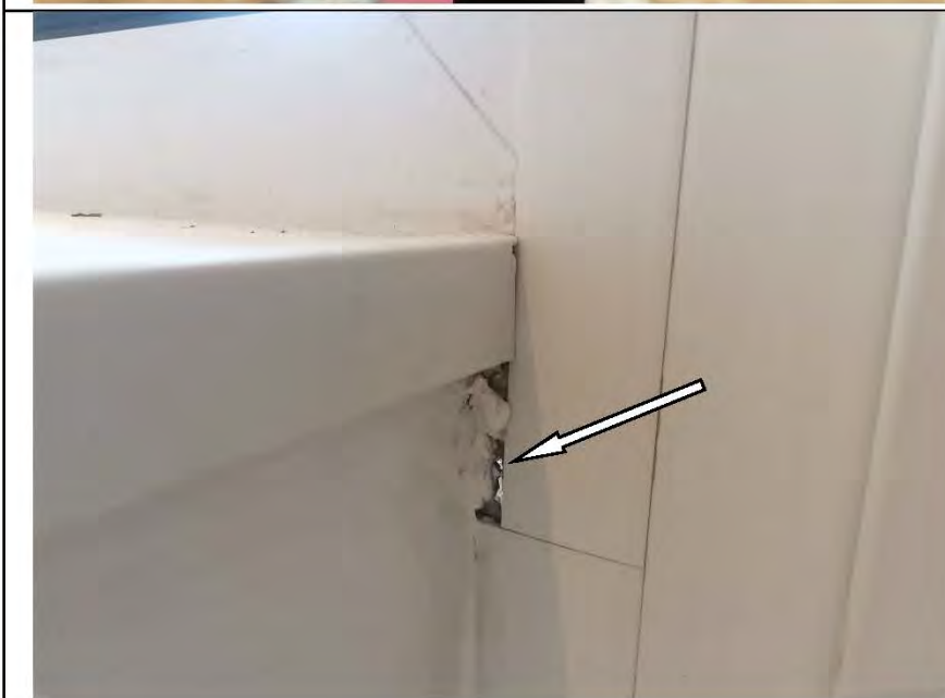
Фото №72. Сквозная щель на стыке откоса и дверного блока в гостиной.
