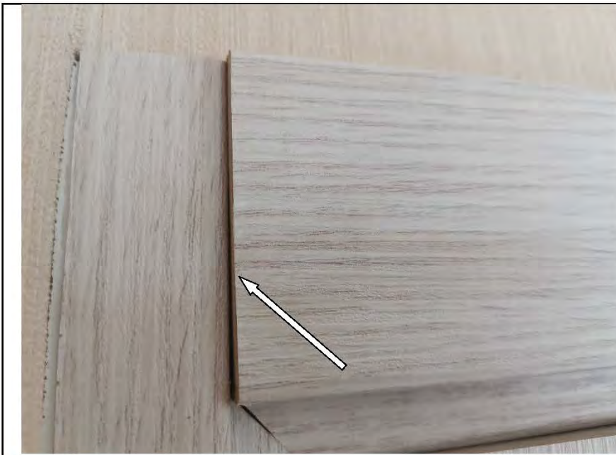
Фото №46. Дверной блок в гостиной смонтирован не надежно.
