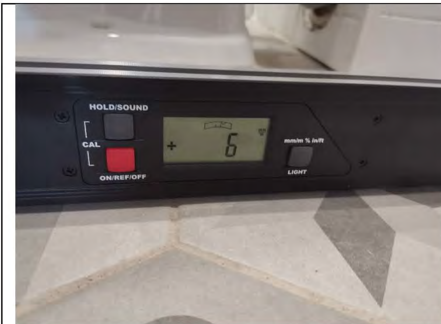
Фото №25. Отклонение напольного покрытия из керамической плитки по горизонтали в санузле.
