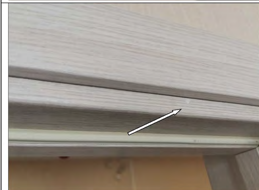
Фото №51. Загрязнение коробки дверного блока в кухне.
