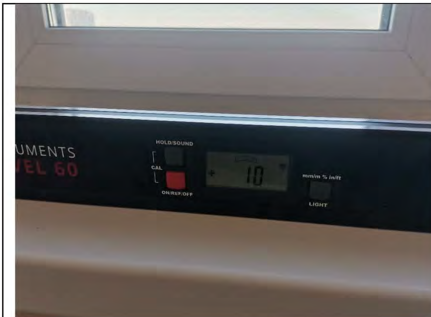
Фото №61. Отклонение подоконной доски по горизонтали в кухне.
