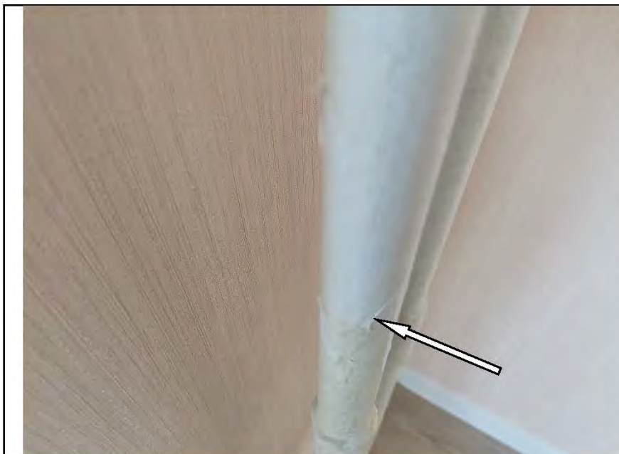
Фото №82. Дефект окрасочного слоя труб отопления в спальне.
