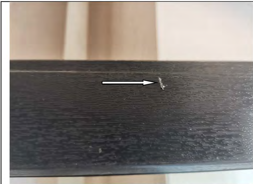
Фото №73. Скол профиля оконного блока в кухне.
