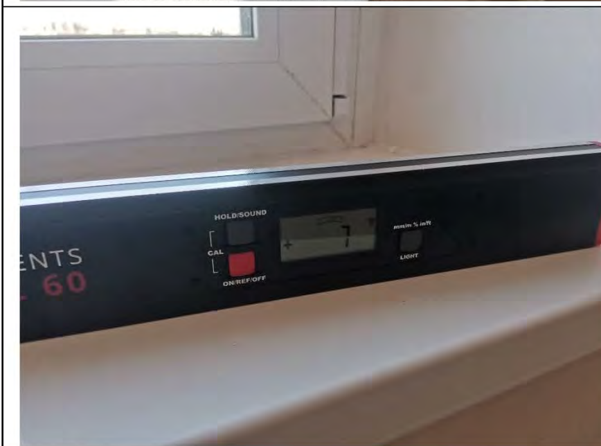
Фото №60. Отклонение подоконной доски по горизонтали в кухне.
