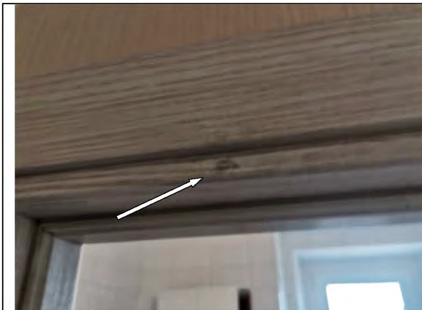
Фото №52. Загрязнение коробки дверного блока в ванной комнате.
