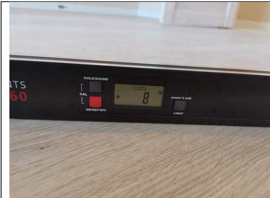
Фото №22. Отклонение напольного покрытия из ламината по горизонтали в гостиной.
