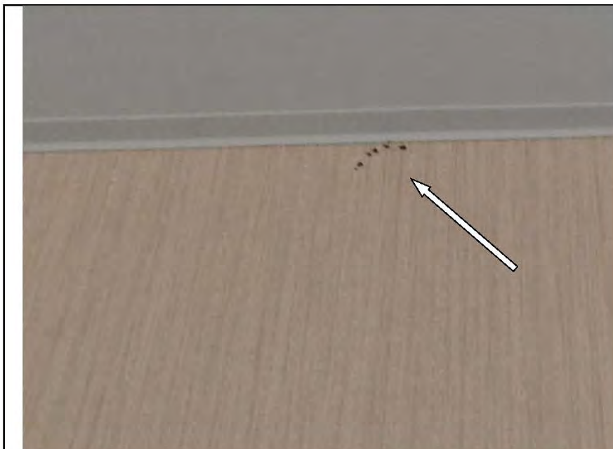
Фото №16. Загрязнение обойного покрытия в гостиной
