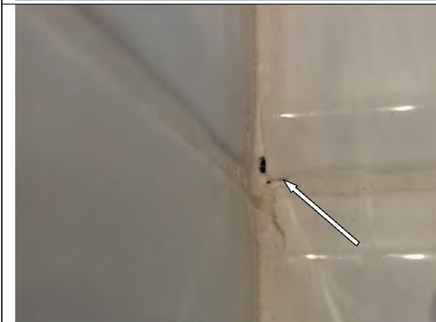
Фото №20. Дефект затирки настенной керамической плитки в санузле.
