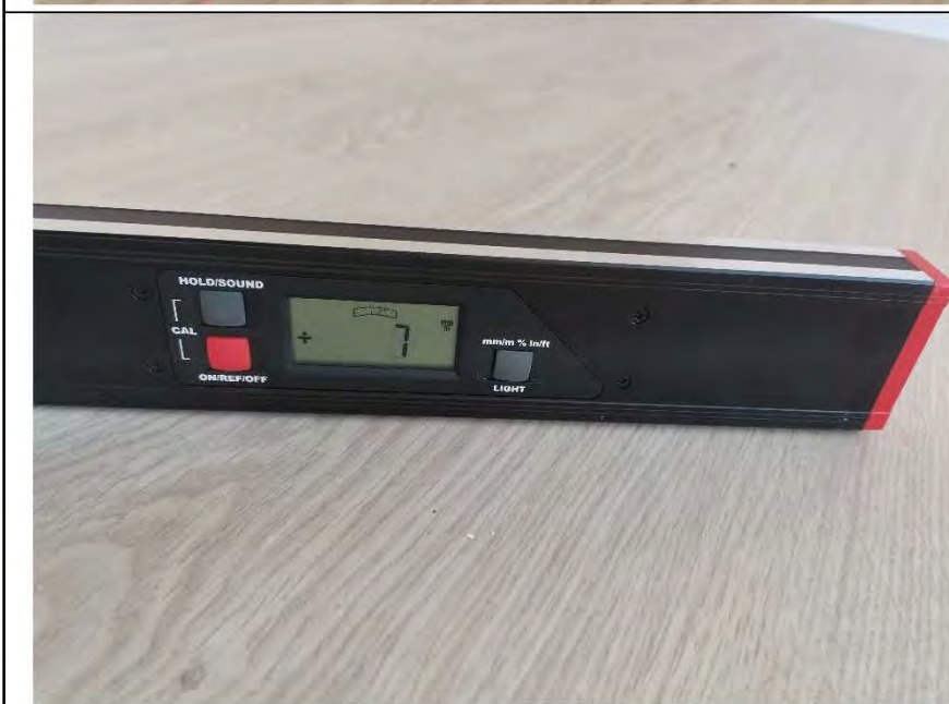
Фото №23. Отклонение напольного покрытия из ламината по горизонтали в спальне.
