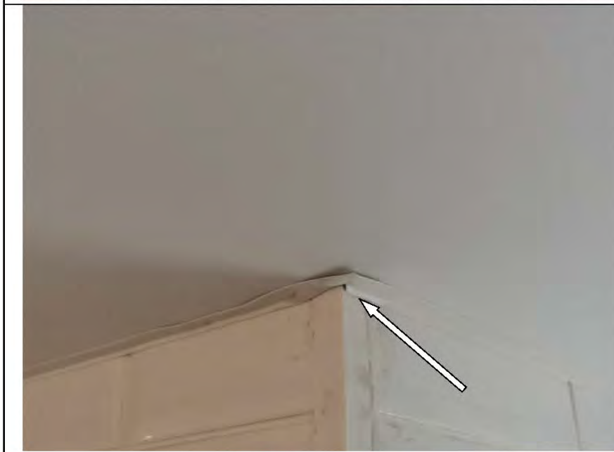
Фото №35. Дефект монтажа потолочного молдинга в санузле
