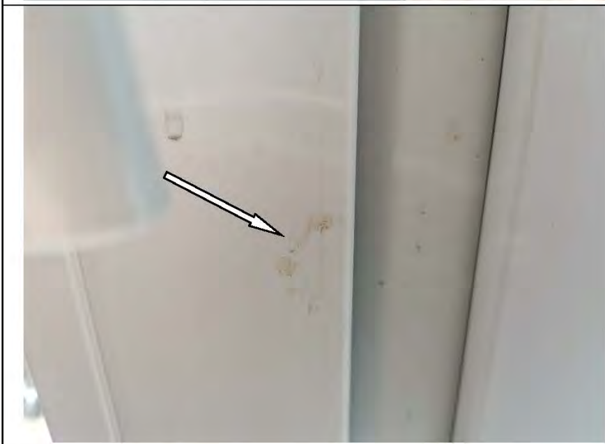
Фото №68. Загрязнение оконного профиля монтажным составом в спальне.
