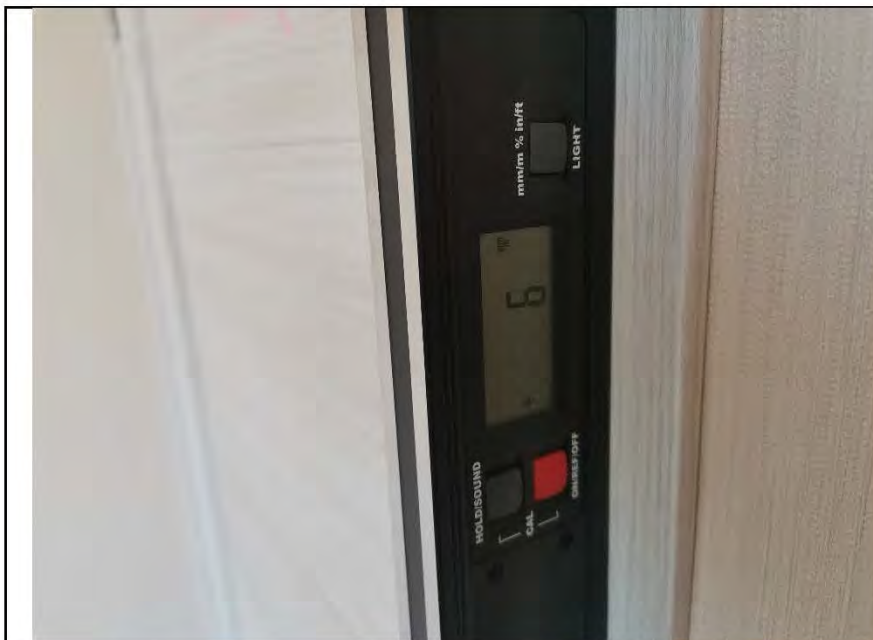
Фото №37. Отклонение наличника дверного блока от вертикали в спальне.
