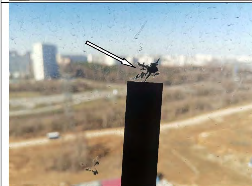
Фото №71. Загрязнение монтажным составом внутренней стороны стеклопакета оконного блока в лоджии.
