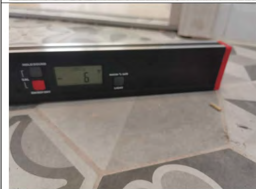
Фото №24. Отклонение напольного покрытия из керамической плитки по горизонтали в ванной комнате.
