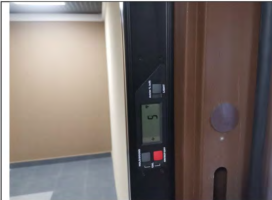
Фото №43. Отклонение коробки входного дверного блока.
