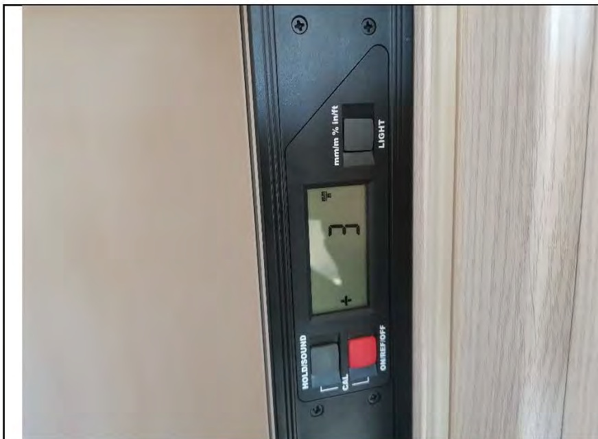
Фото №40. Отклонение коробки дверного блока в спальне.
