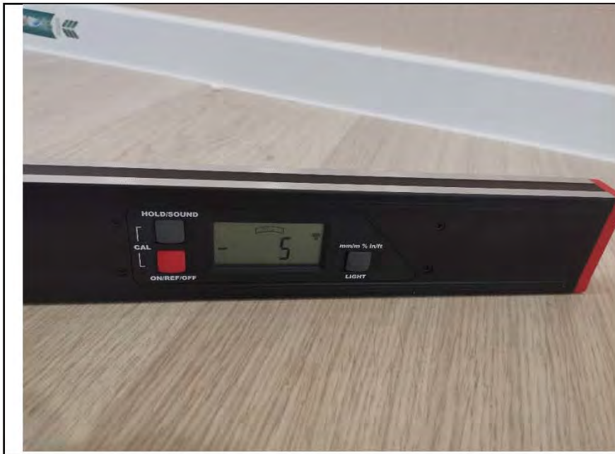
Фото №85. Отклонение напольного покрытия из ламината в коридоре.
