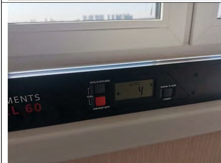
Фото №63. Отклонение подоконной доски по горизонтали в спальне.
