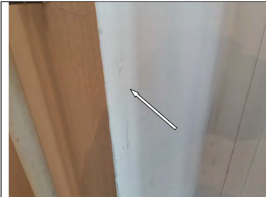
Фото №58. Дефект окрасочного слоя откосов в гостиной.
