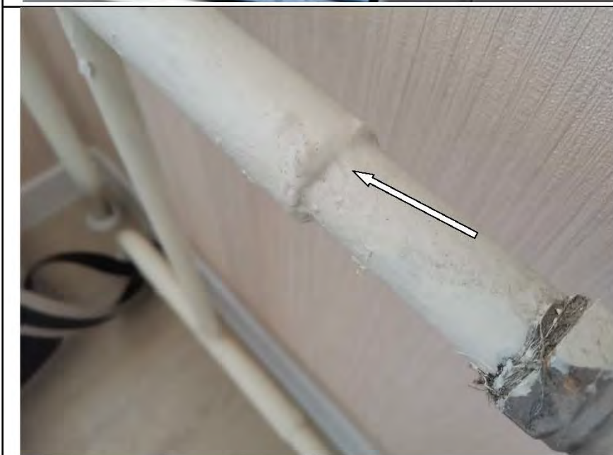
Фото №80. Дефект окрасочного слоя труб отопления в кухне.
