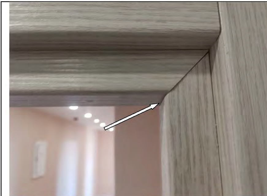
Фото №49. Дверной блок в санузле смонтирован не надежно.
