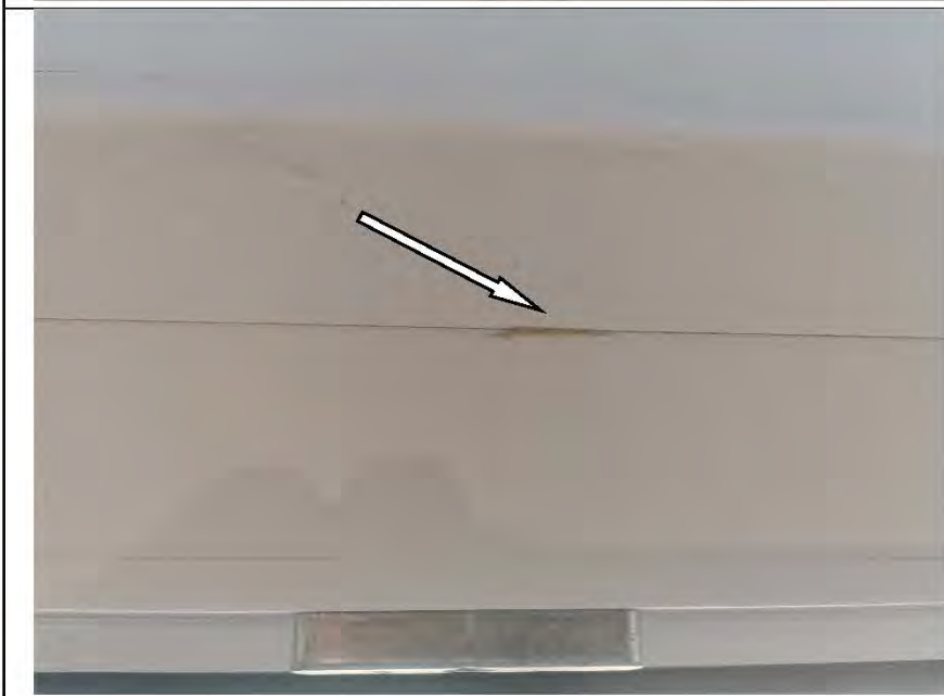
Фото №66. Загрязнение оконного профиля монтажным составом в гостиной..
