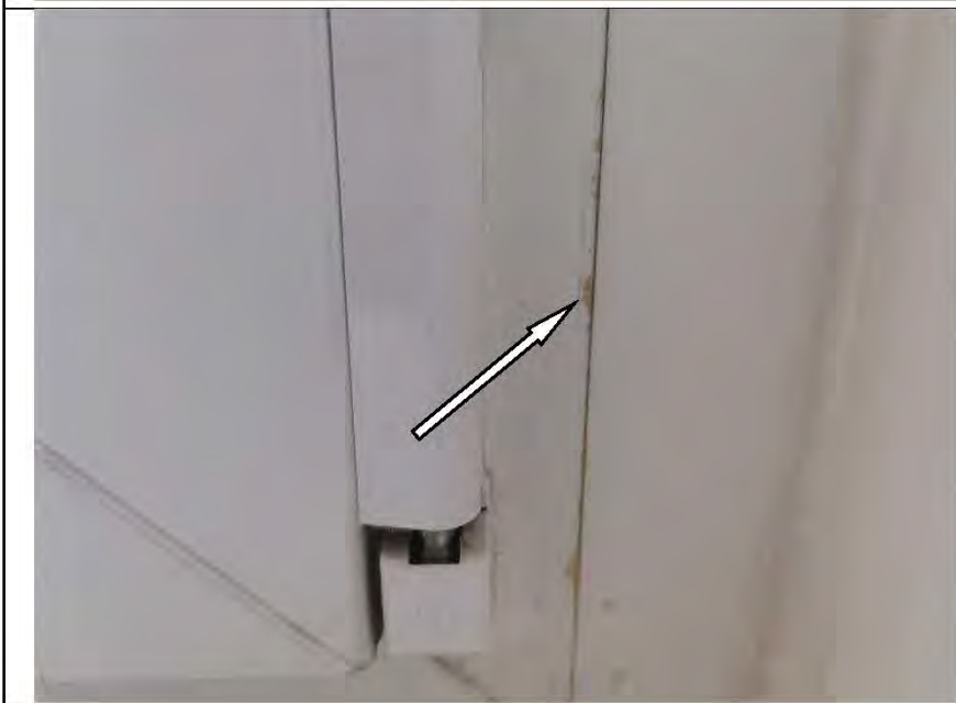
Фото №65. Загрязнение оконного профиля монтажным составом в кухне.
