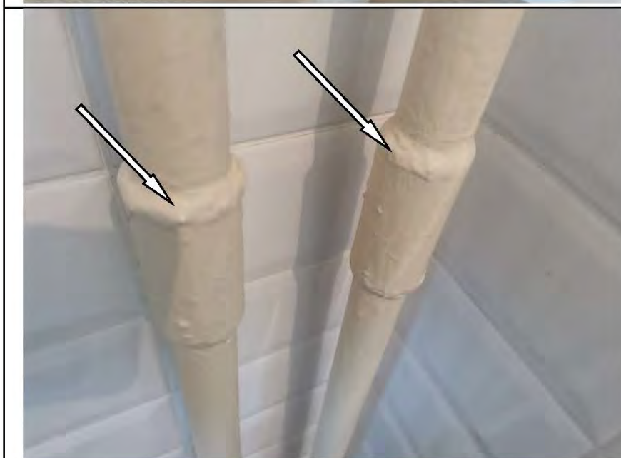
Фото №83. Дефект окрасочного слоя труб отопления в ванной комнате.
