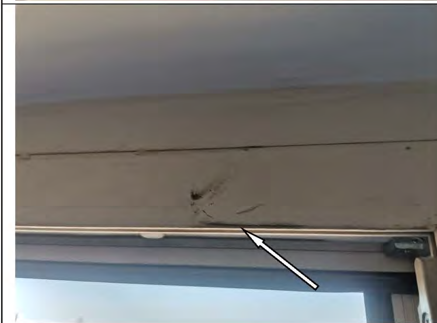
Фото №77. Загрязнение оконного блока свидетельствующие об инфильтрации в кухне.
