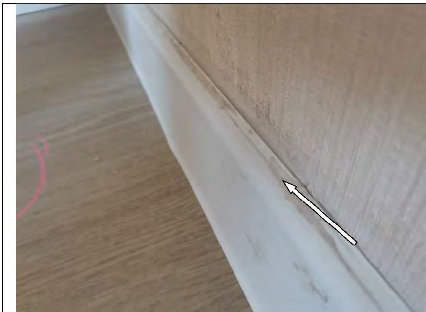
Фото №28. Загрязнение монтажным составом напольного ПВХ плинтуса в кухне.
