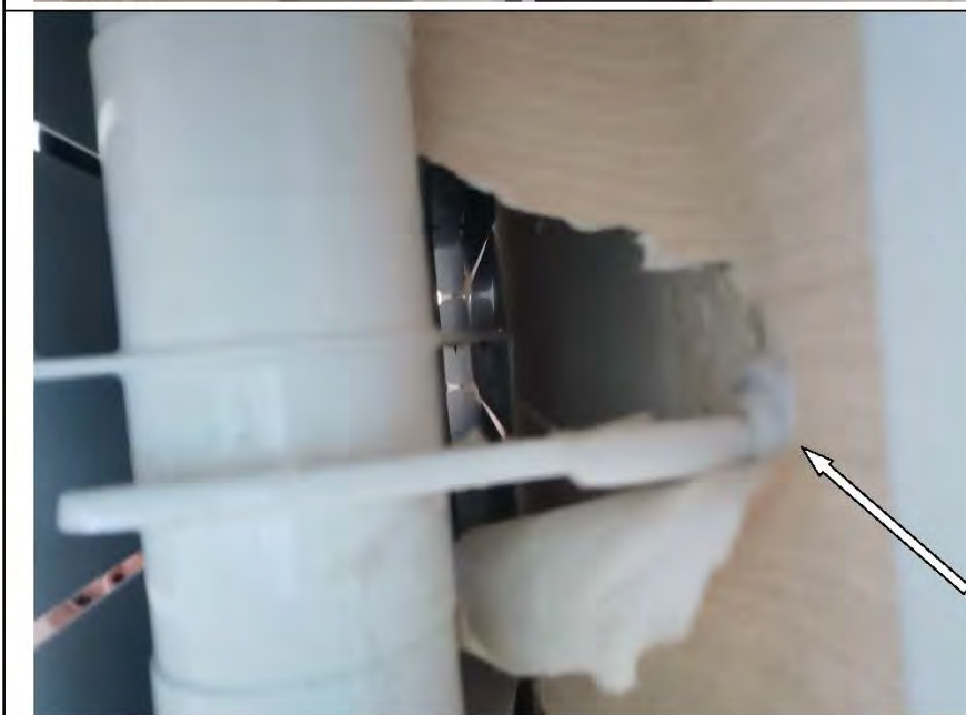
Фото №15. Разрыв обоевого покрытия в кухне.
