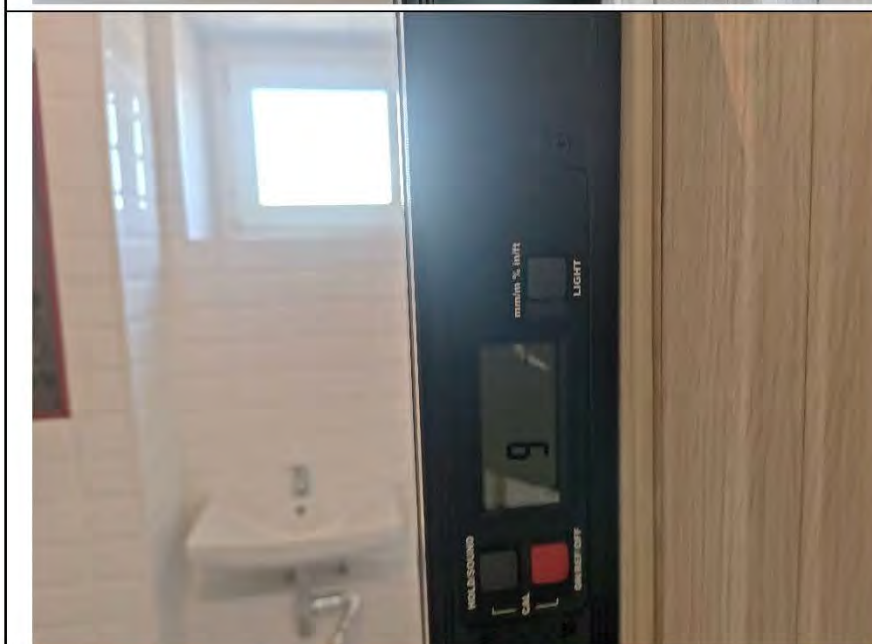
Фото №41. Отклонение коробки дверного блока в ванной комнате.
