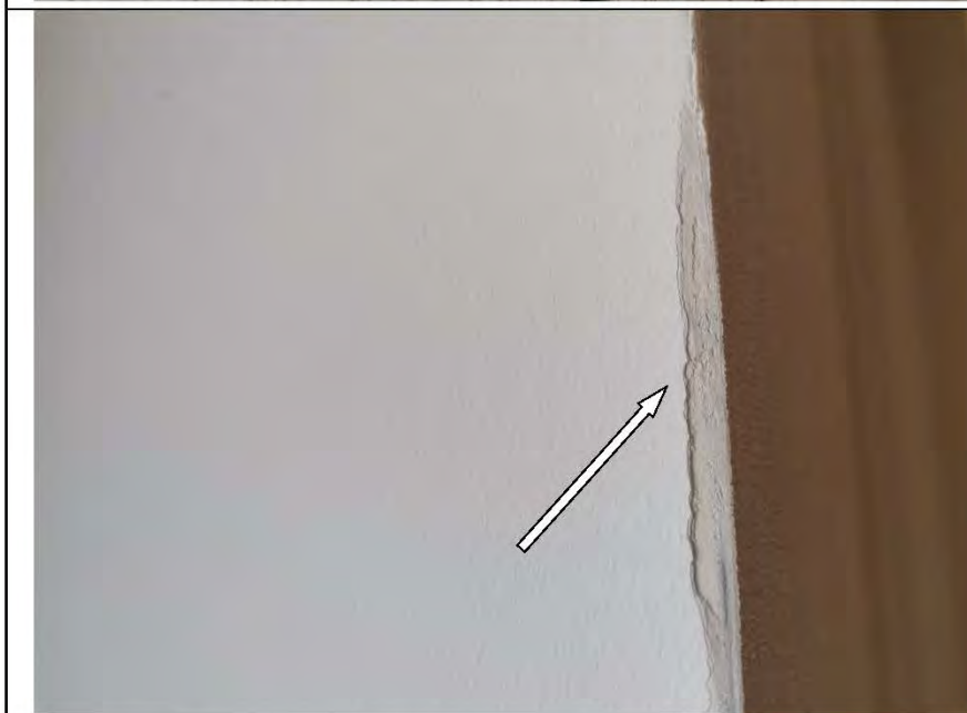
Фото №56. Дефект окрасочного слоя откосов в кухне.
