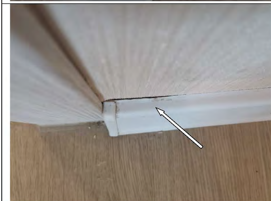
Фото №30. Зазор между напольным ПВХ плинтусом и стеной в гостиной.
