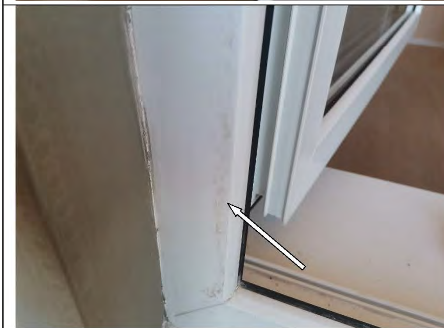
Фото №54. Загрязнение профиля дверного ПВХ блока в гостиной.
