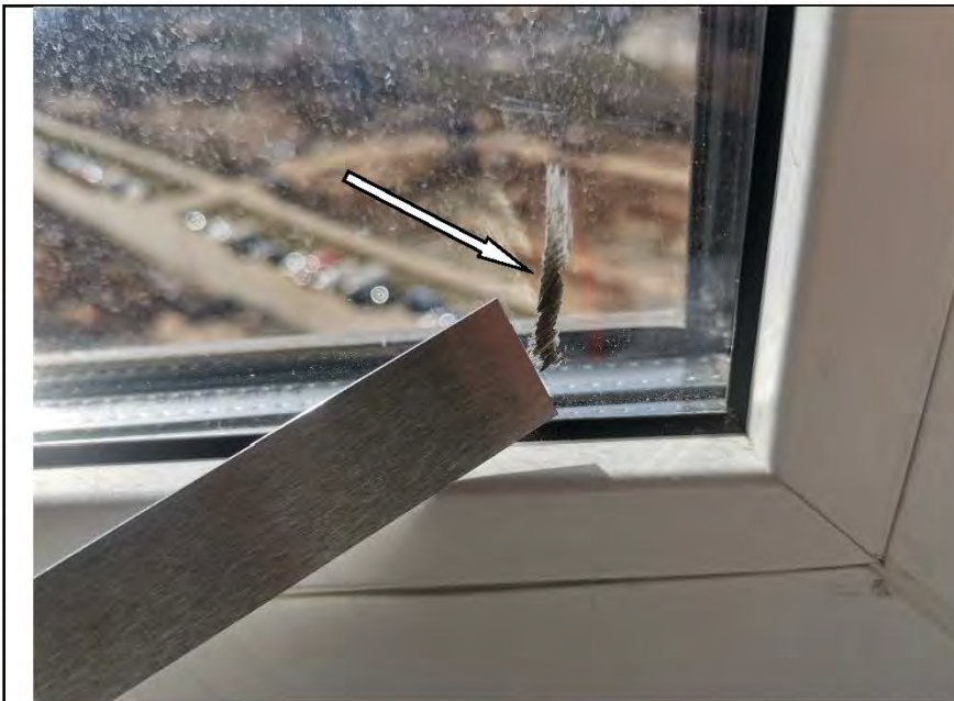
Фото №70. Загрязнение монтажным составом внутренней стороны стеклопакета оконного блока в спальне.
