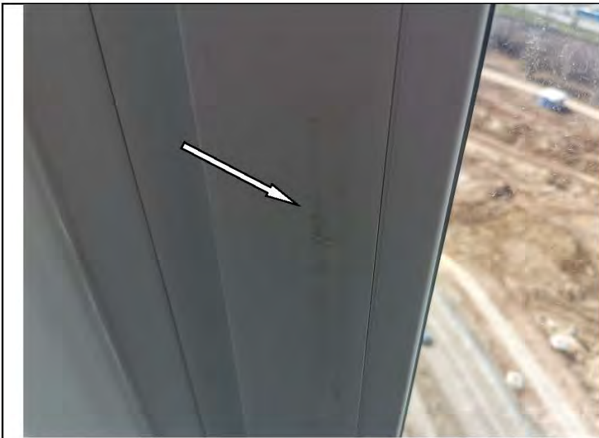
Фото №67. Загрязнение оконного профиля монтажным составом в спальне.
