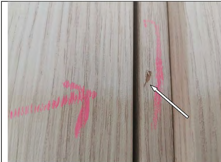
Фото №55. Механический дефект коробки дверного блока в спальне.
