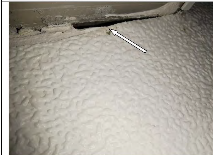
Фото №38. Отверстие под подоконником в спальне не загерметизировано.
