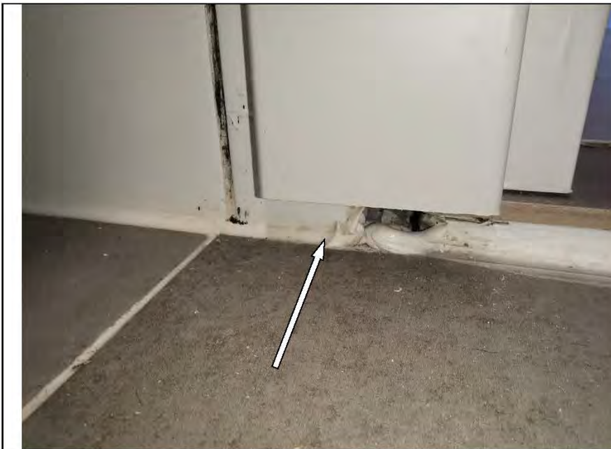
Фото №46. Коротко подрезаны наличники деревянного дверного блока в ванной комнате.
