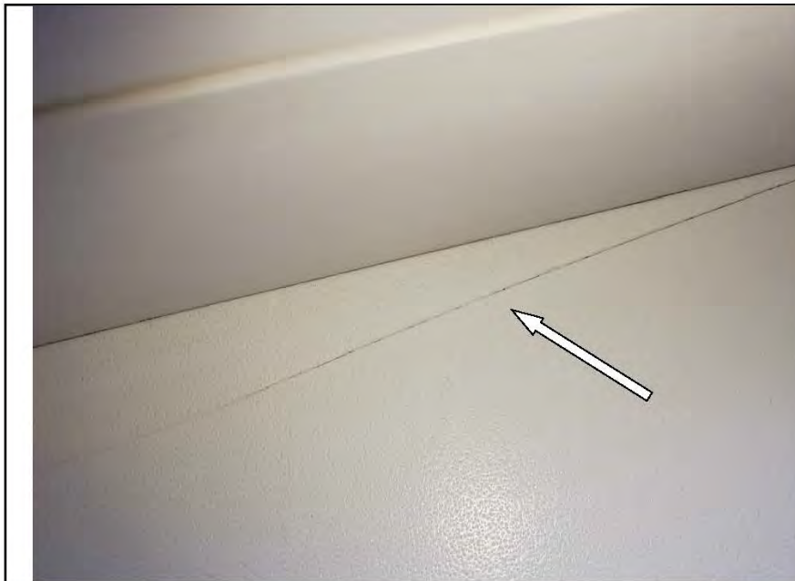
Фото №37. Царапины на лицевой поверхности подоконной доски в кухне-гостиной.
