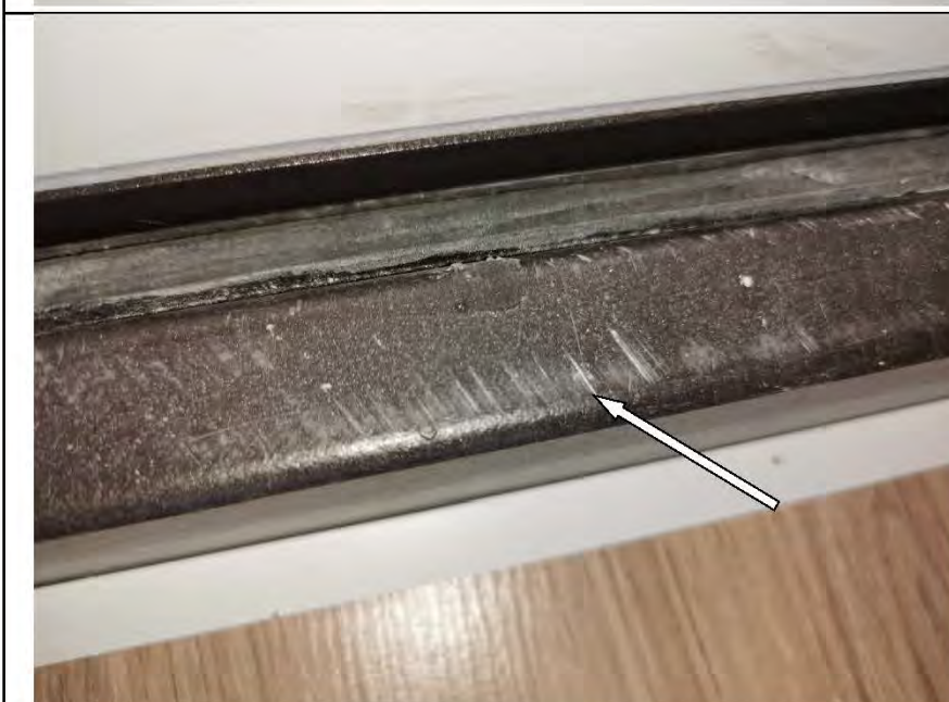
Фото №48. Царапины и потертости на металлическом коробе входного дверного блока.
