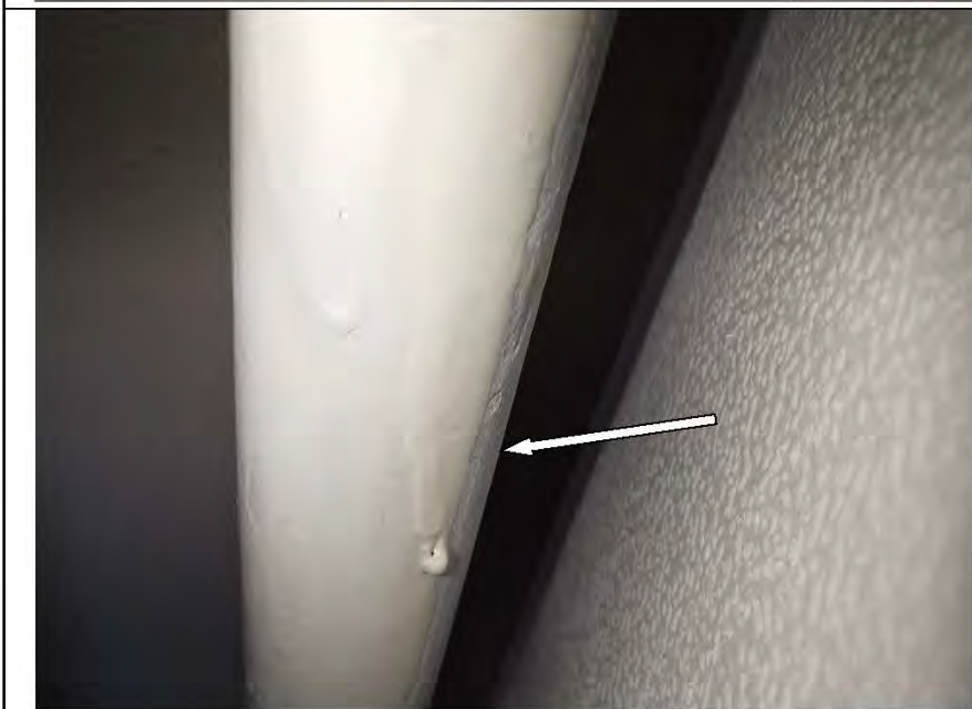
Фото №51. Окрашивание труб отопления в спальне выполнено с дефектами.
