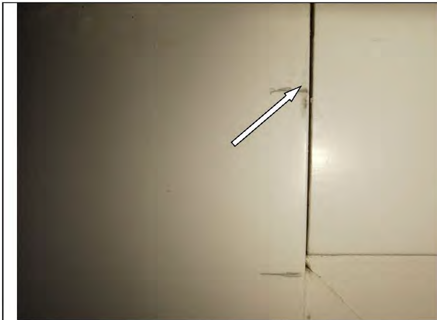
Фото №31. Зазоры в месте стыка профилей ПВХ оконного блока в кухне-гостиной.
