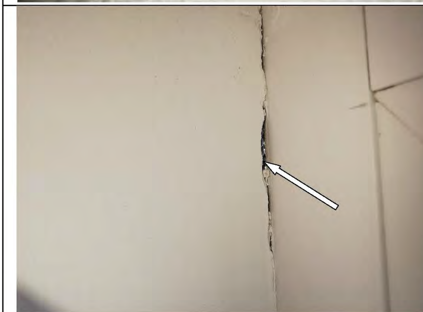
Фото №39. Щели в месте примыкания оконного блока к стене в кухне-гостиной.
