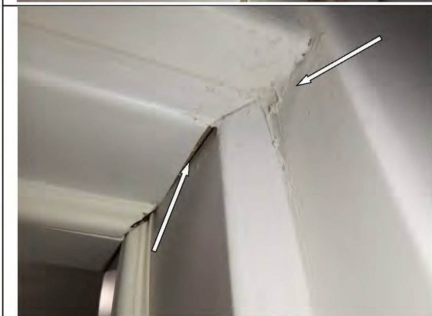
Фото №42. Ненадежное соединение элементов короба деревянного дверного блока, загрязнение короба и наличников дверного блока в ванной комнате.
