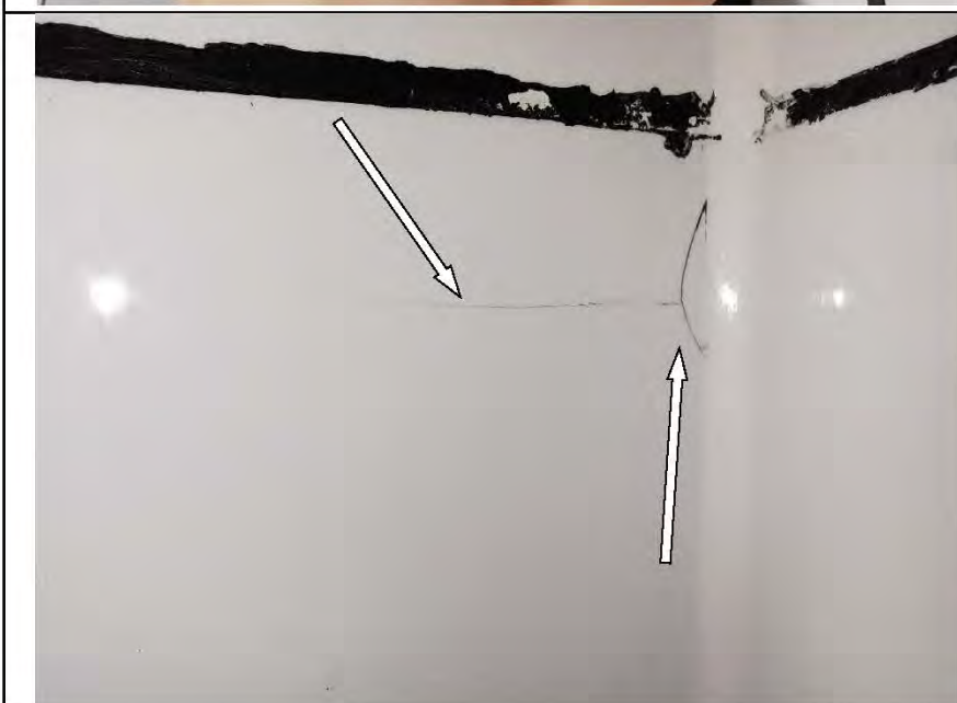
Фото №17. Трещины на настенной плитке в ванной комнате.
