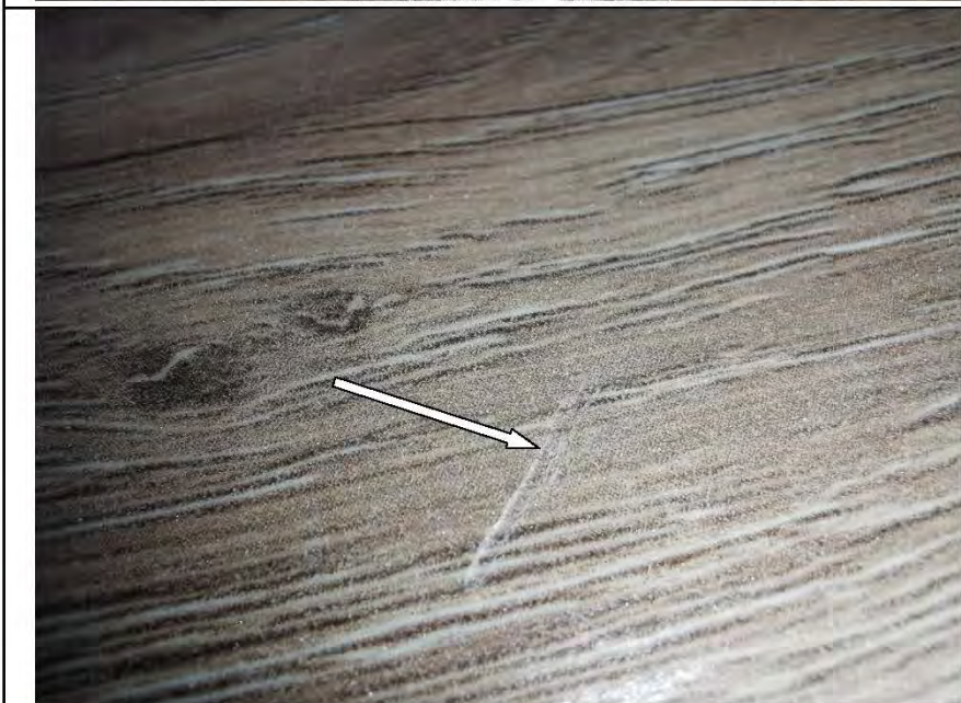
Фото №23. Царапины на ламинате в спальне
