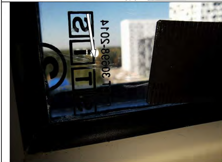
Фото №33. Царапины на стеклопакете оконного блока ПВХ в спальне.
