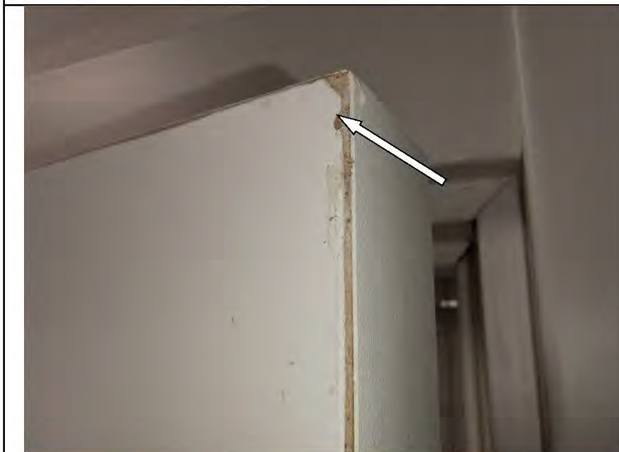
Фото №41. Повреждение ламинации полотна деревянного дверного блока в ванной комнате.
