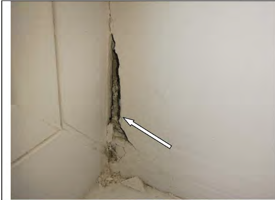
Фото №40. Разрушение штукатурного слоя откосов оконного блока в спальне.
