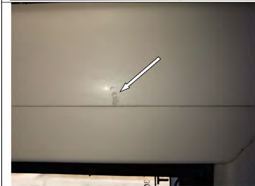
Фото №32. Потертости на профиле ПВХ оконного блока в кухне-гостиной.
