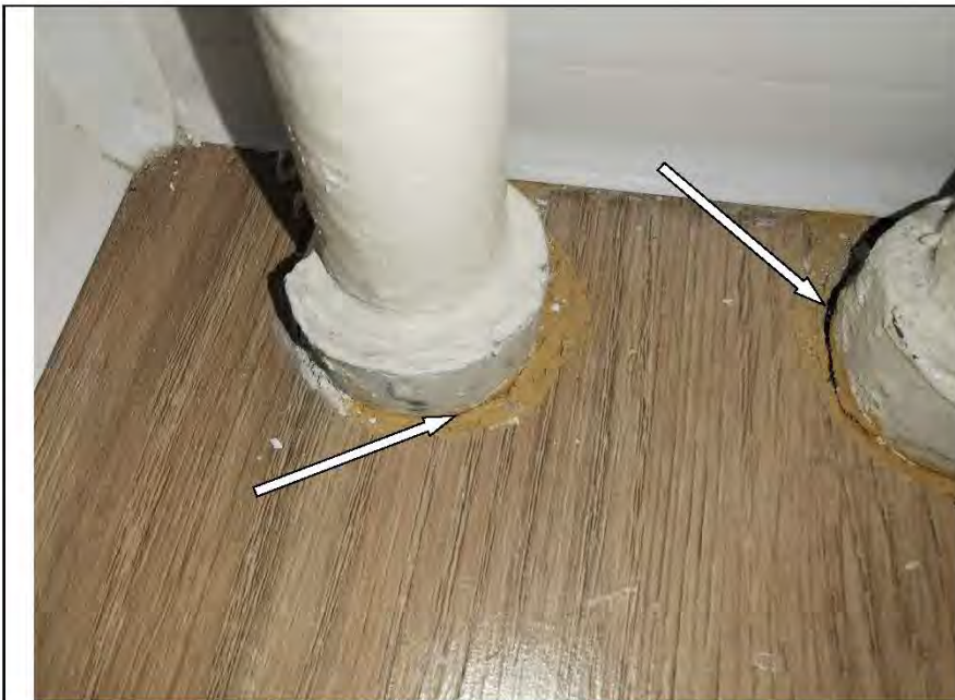
Фото №25. Дефект заделки отверстия для трубопровода отопления в напольном покрытии из ламината в спальне.
