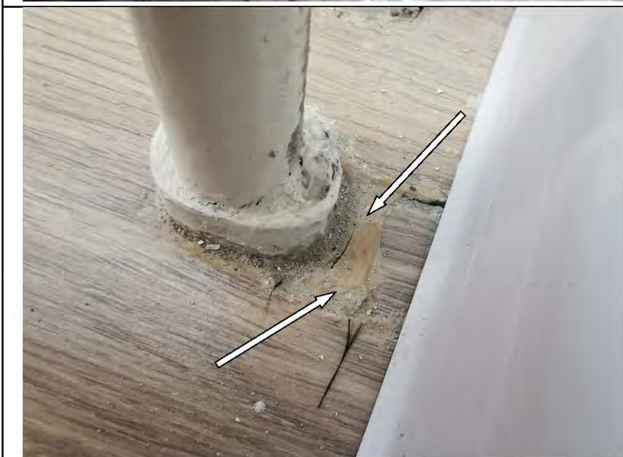
Фото №24. Дефект заделки отверстия для трубопровода отопления в напольном покрытии из ламината в кухне-гостиной.
