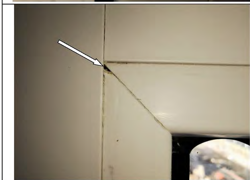
Фото №30. Зазоры в месте стыка профилей ПВХ оконного блока в спальне.
