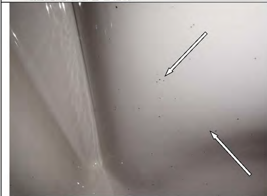
Фото №50. Окалины на унитазе в ванной комнате.
