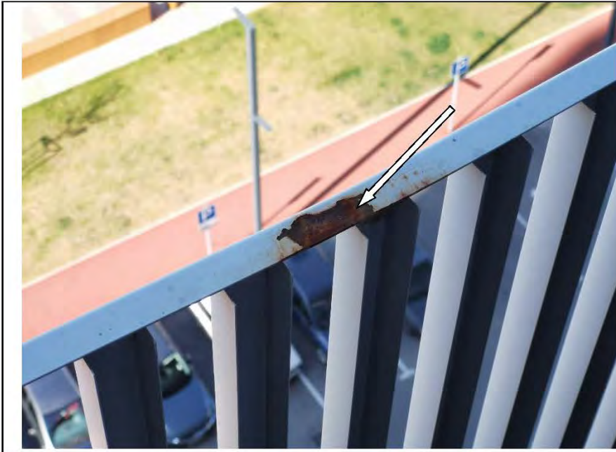
Фото №52. Коррозия на коробе для установки кондиционера в кухне-гостиной.
