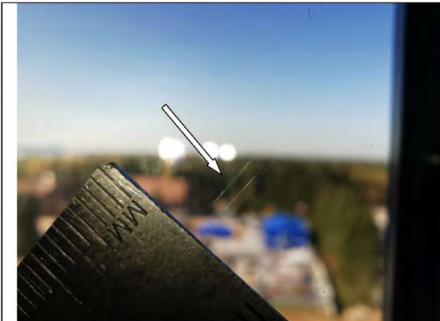
Фото №34. Царапины на стеклопакете оконного блока ПВХ в спальне.
