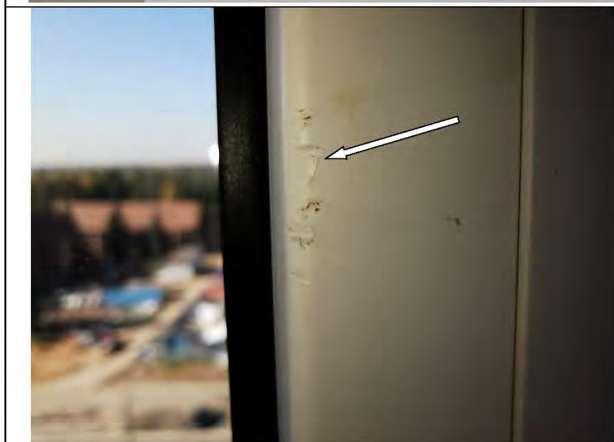
Фото №29. Потертости на профиле ПВХ оконного блока в спальне.
