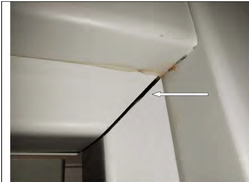
Фото №43. Ненадежное соединение элементов короба деревянного дверного блока в ванной комнате
