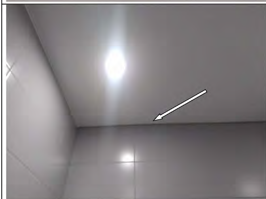
Фото №35. Дефект монтажа декоративного молдинга натяжного потолка в ванной комнате.
