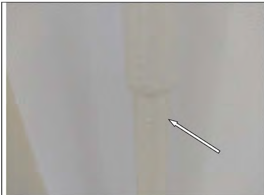
Фото №40. Окрашивание труб отопления выполнено с дефектами (подтеки) в кухне
