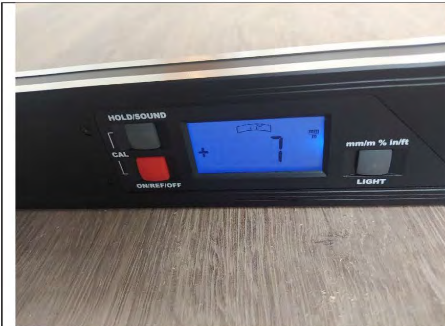
Фото №10. Измерение уровня напольного покрытия в кухне.
