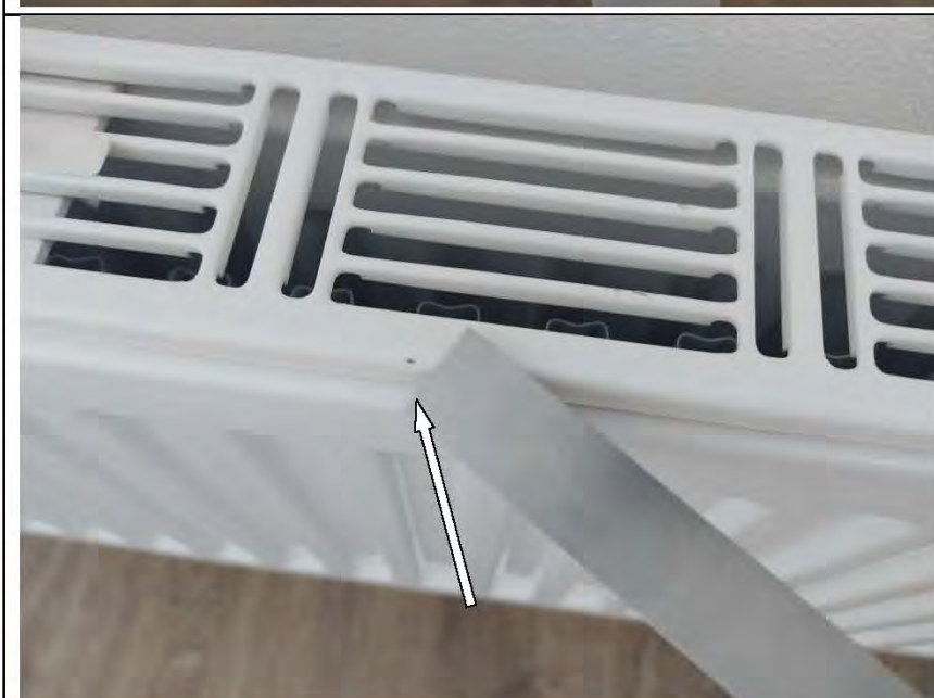
Фото №39. Отопительный прибор имеет дефект покраски защитного кожуха в спальне (скол)
