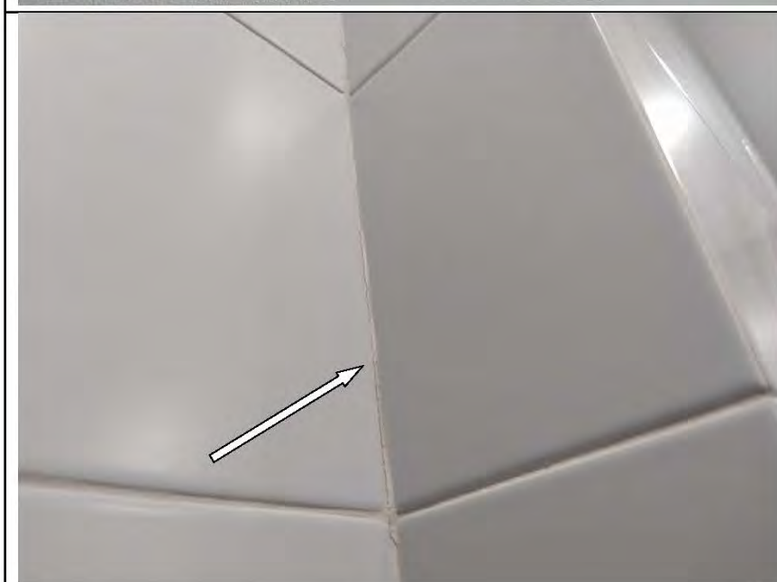
Фото №30. Затирка настенной плитки в ванной комнате выполнена с нарушениями (трещины)
