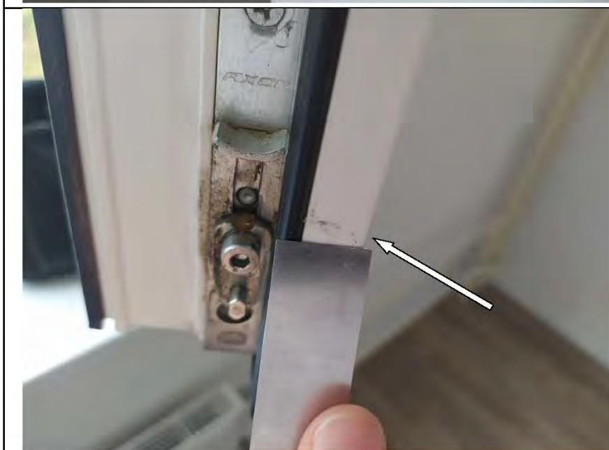
Фото №15. Профиль ПВХ оконного блока в спальне имеет дефекты (стертость).
