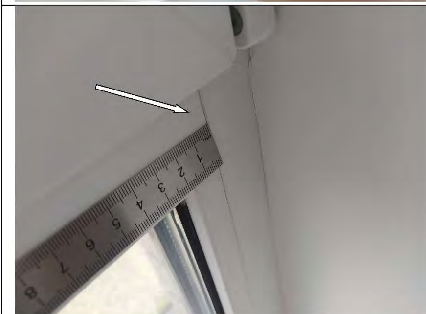
Фото №17. Профиль ПВХ оконного блока в кухне имеет дефекты (зазор).
