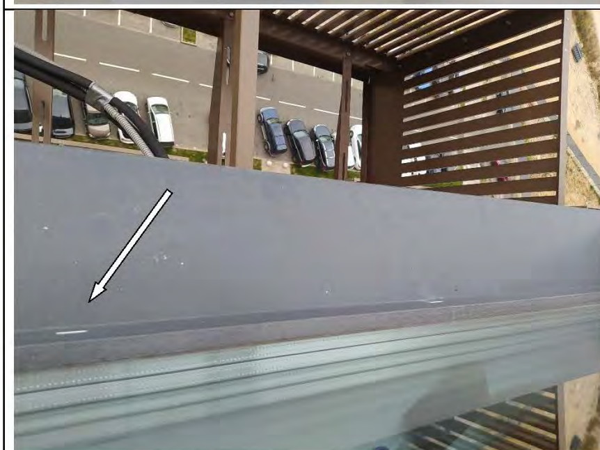
Фото №42. Отсутствуют декоративные козырьки для водосливных отверстий оконного блока в спальне
