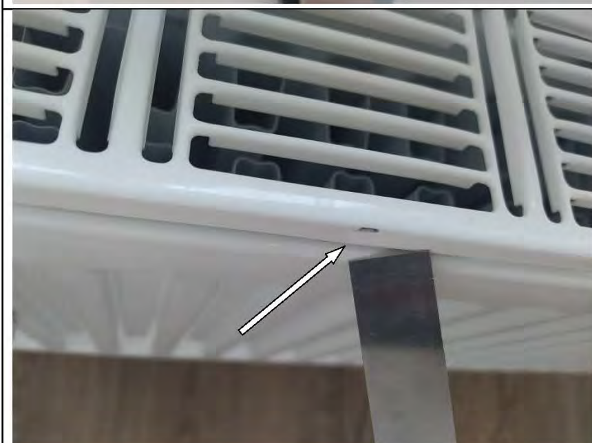
Фото №38. Отопительный прибор имеет дефект покраски защитного кожуха в кухне (скол)
