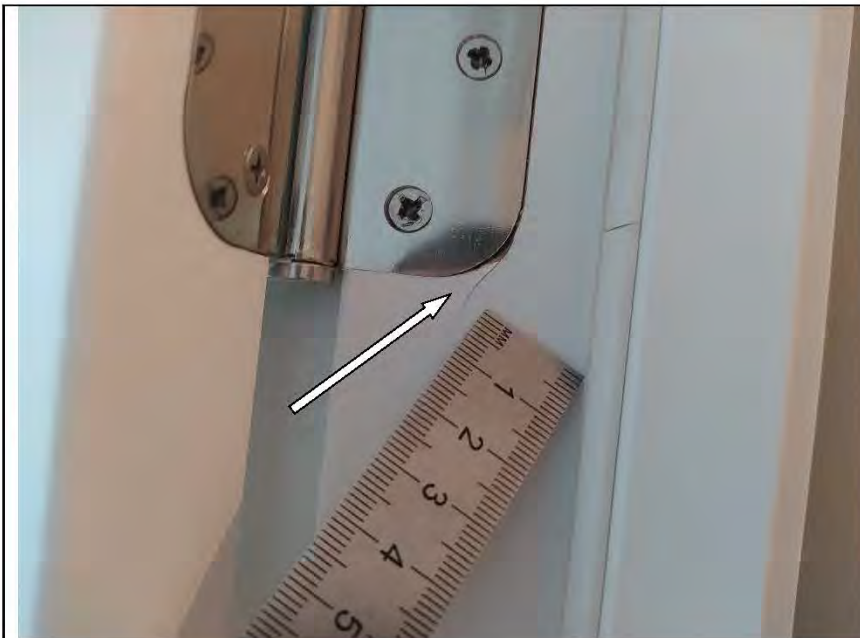
Фото №22. Коробка деревянного дверного блока в кухне имеет дефекты (царапина).
