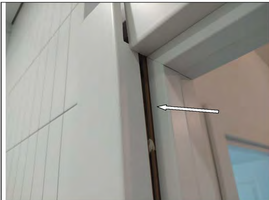
Фото №25. Неплотное прилегание дверного наличника к стене в ванной комнате
