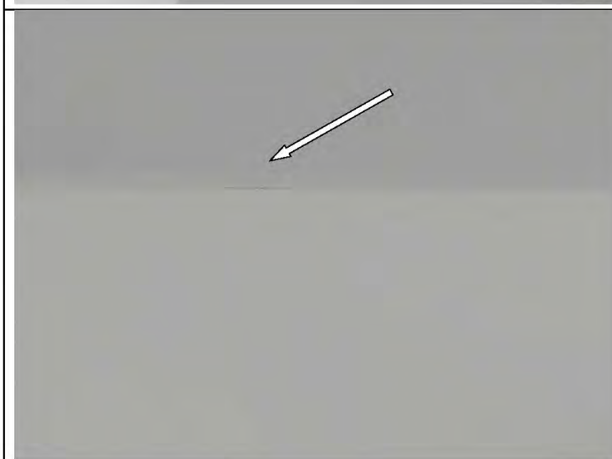
Фото №33. Дефект монтажа декоративного молдинга натяжного потолка в спальне.
