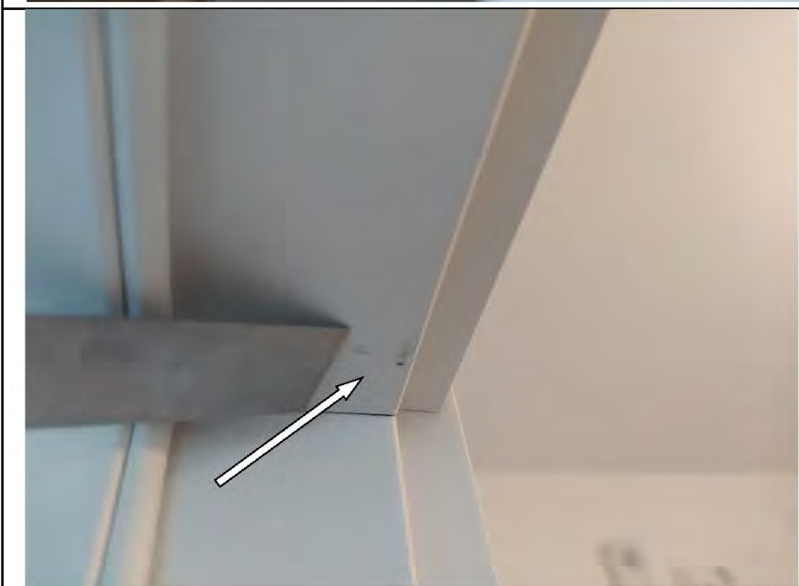
Фото №21. Коробка деревянного дверного блока в спальне имеет дефекты (стертость).
