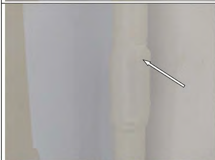
Фото №41. Окрашивание труб отопления выполнено с дефектами (подтеки) в спальне
