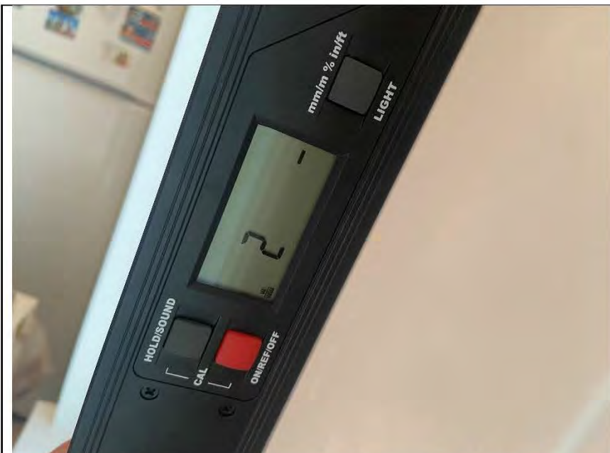
Фото №55. Отклонения от вертикали оконного блока ПВХ в кухне.
