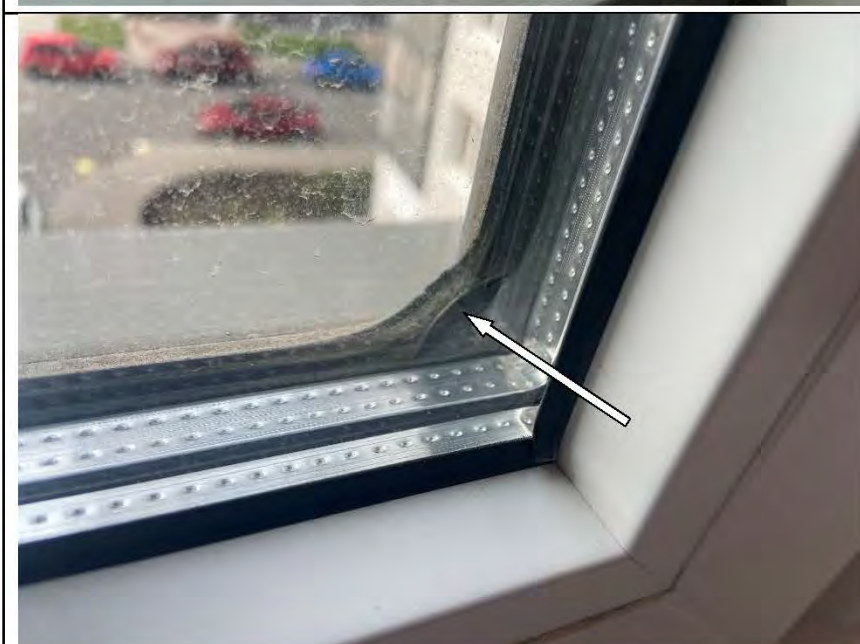
Фото №59. Дефект на уплотнительной ленте оконного блока ПВХ в спальне.
