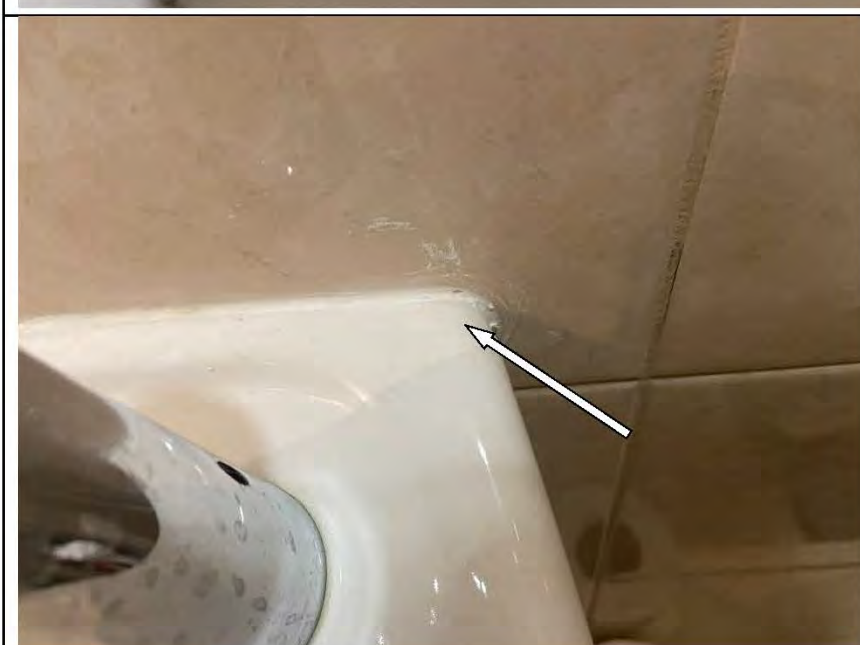
Фото №93. Загрязнения на раковине в санузле.
