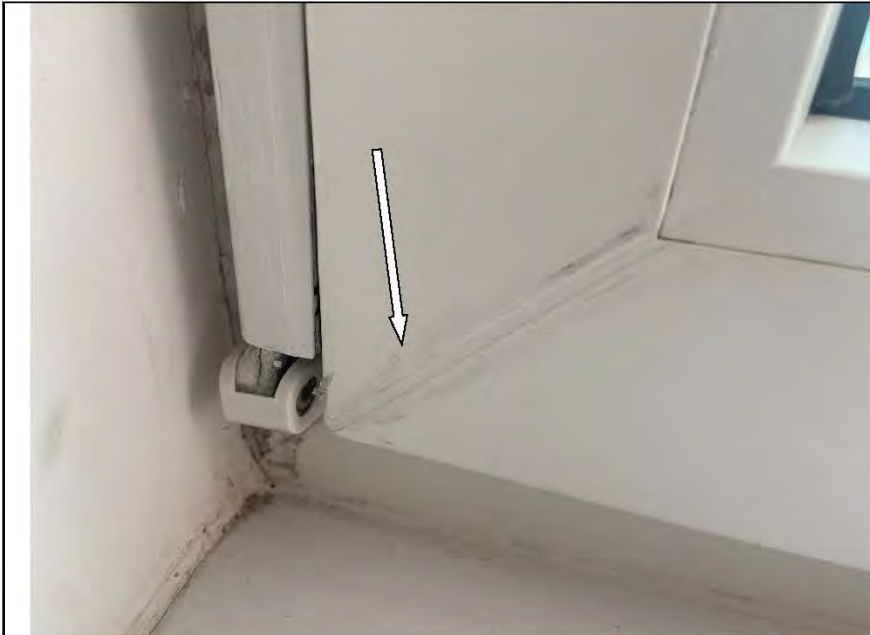
Фото №46. Дефект на профиле оконного блока ПВХ в спальне.
