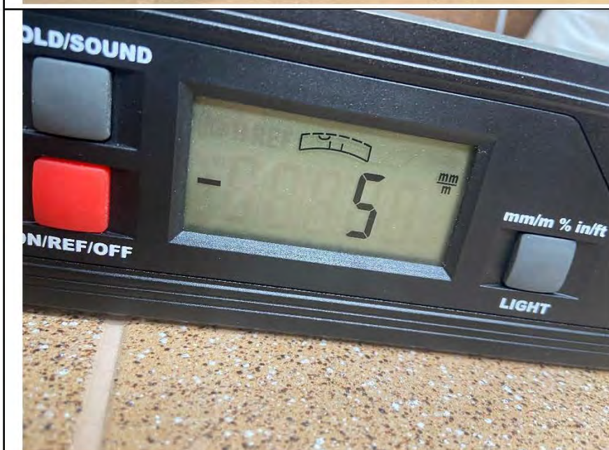
Фото №23. Отклонение поверхности напольного покрытия из керамической плитки на лоджии.
