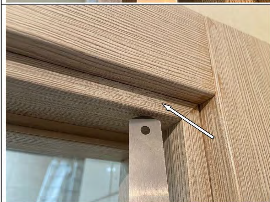
Фото №75. Дефект на коробке деревянного дверного блока в ванной комнате.
