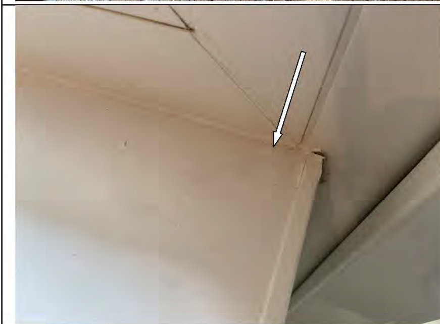
Фото №42. Дефект на лицевой стороне подоконной доски в кухне.
