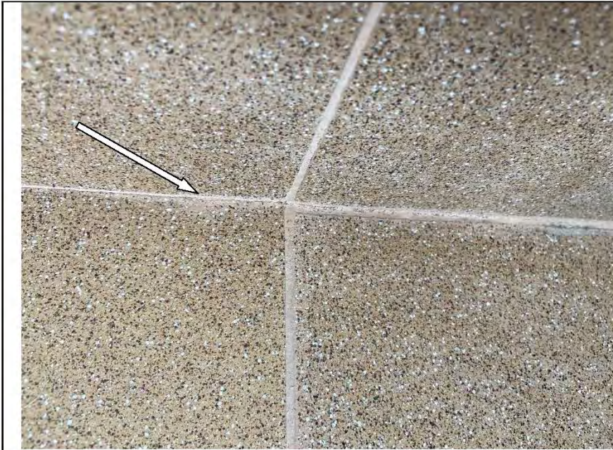
Фото №31. Неровные швы напольной керамической плитки на лоджии.
