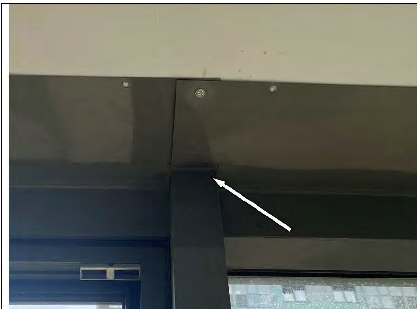
Фото №61. Дефект на алюминиевом профиле оконного блока на лоджии.
