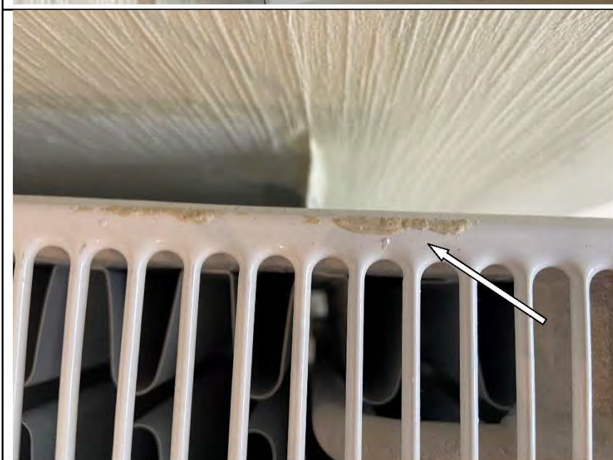
Фото №90. Дефект на поверхности металлического кожуха отопительного прибора в кухне.
