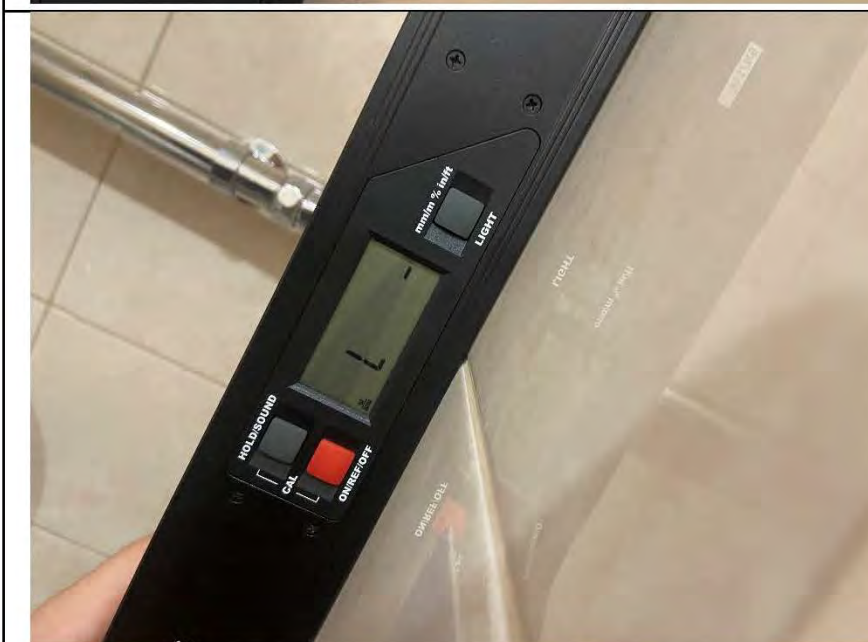
Фото №11. Отклонение поверхности стен от вертикали в ванной комнате.
