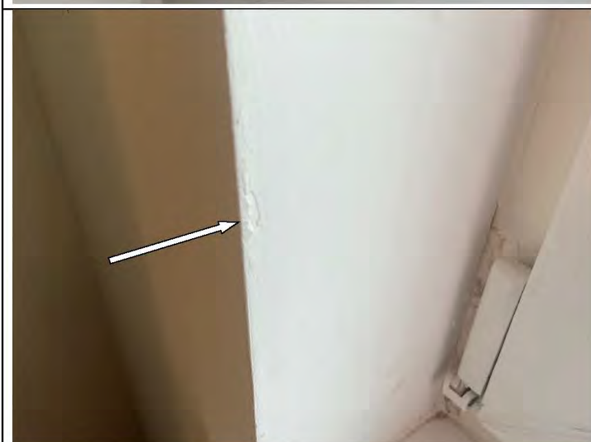
Фото №53. Неровности, выбоины, раковины на окрашенных откосах оконного блока ПВХ в спальне.
