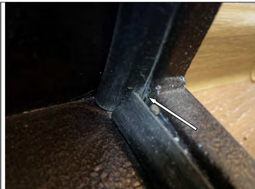
Фото №82. Дефект на уплотнительной противопожарной ленте входного дверного блока в коридоре.
