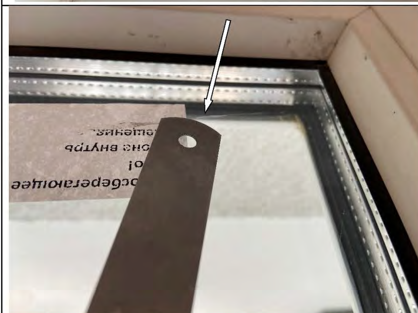
Фото №47. Царапина на стеклопакете оконного блока ПВХ в кухне.
