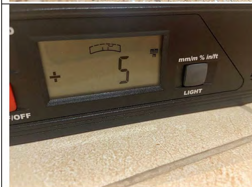
Фото №24. Отклонение поверхности напольного покрытия из керамической плитки в ванной комнате.
