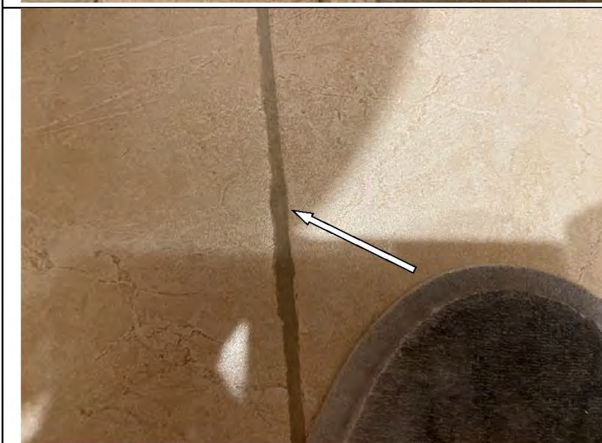
Фото №29. Загрязнения на напольной керамической плитке в санузле.
