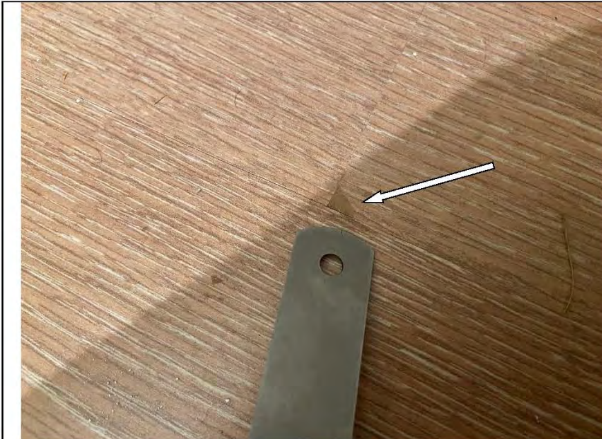
Фото №37. Дефект на напольном покрытии из ламината в коридоре.
