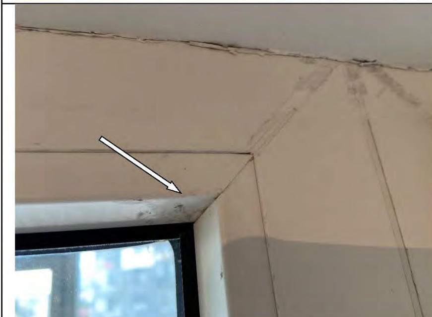
Фото №44. Дефект на профиле оконного блока ПВХ в кухне.
