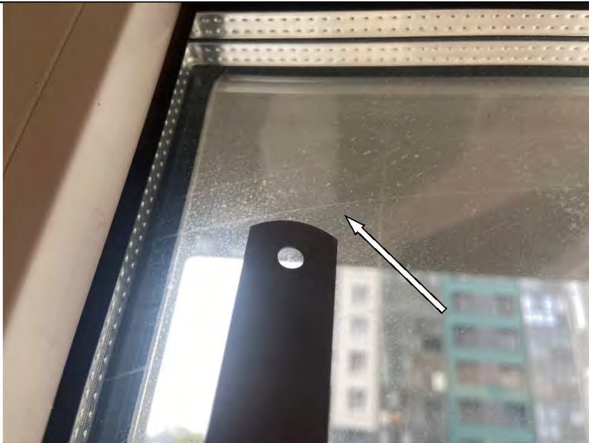
Фото №50. Царапина на стеклопакете оконного блока ПВХ в спальне.
