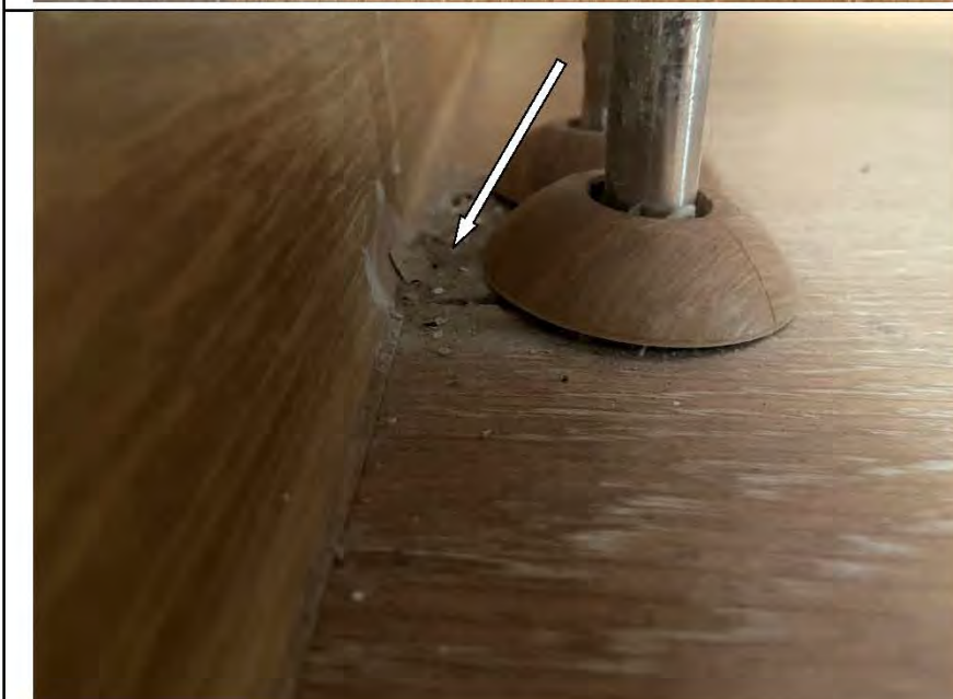
Фото №39. Дефект на напольном покрытии из ламината в спальне.
