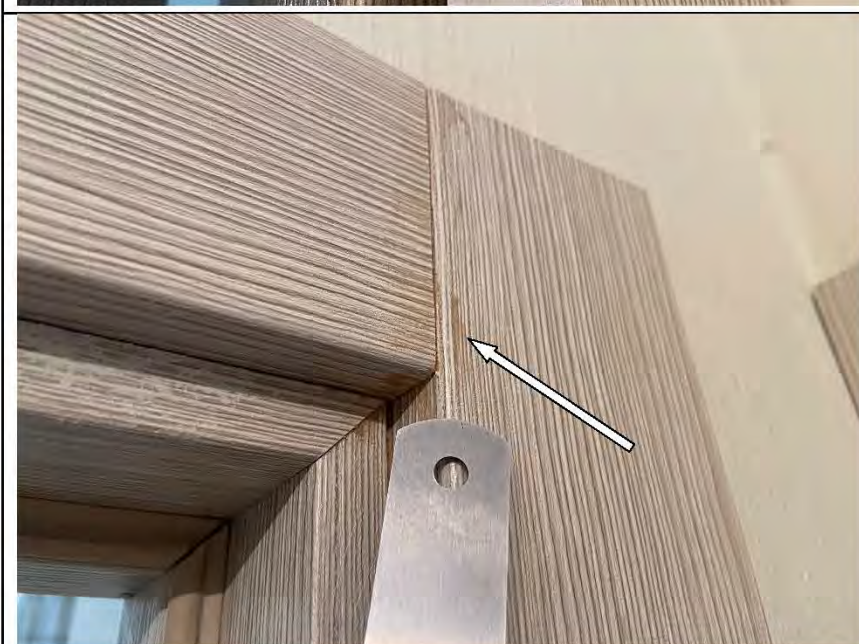
Фото №71. Дефект на наличниках деревянного дверного блока в ванной комнате.
