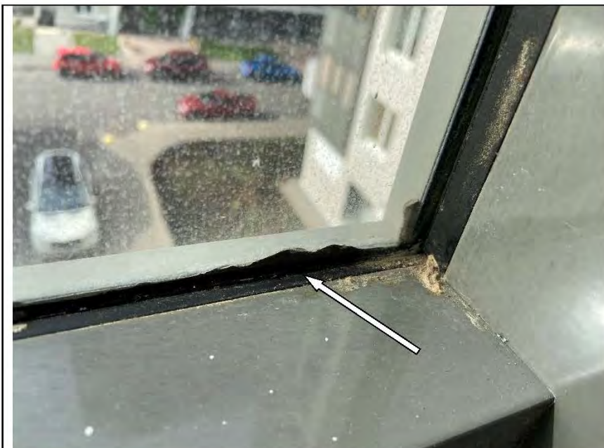
Фото №58. Дефект на уплотнительной ленте алюминиевого оконного блока на лоджии.
