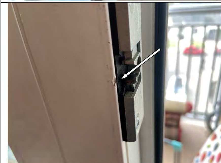
Фото №45. Дефект на профиле оконного блока ПВХ в кухне.
