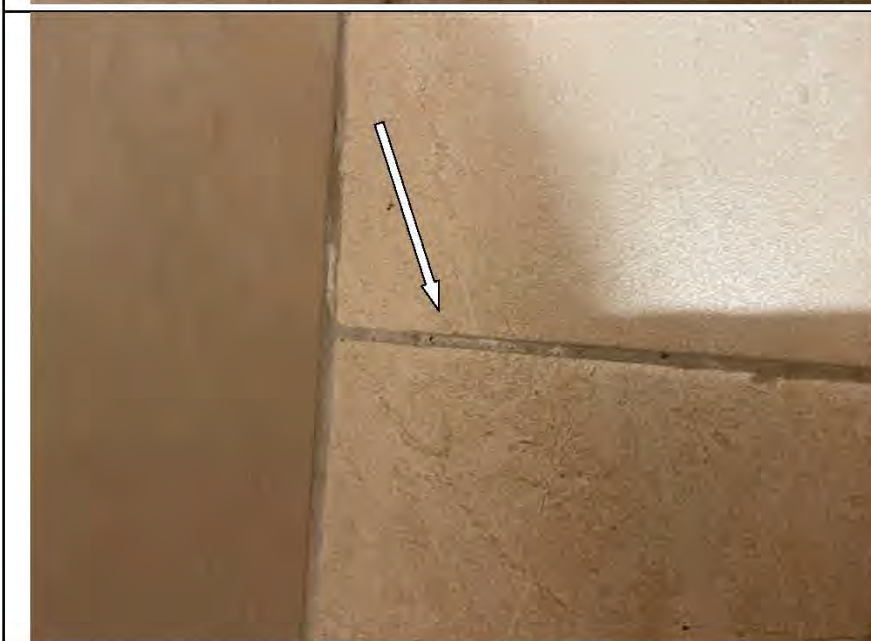
Фото №33. Неровные швы напольной керамической плитки в санузле.
