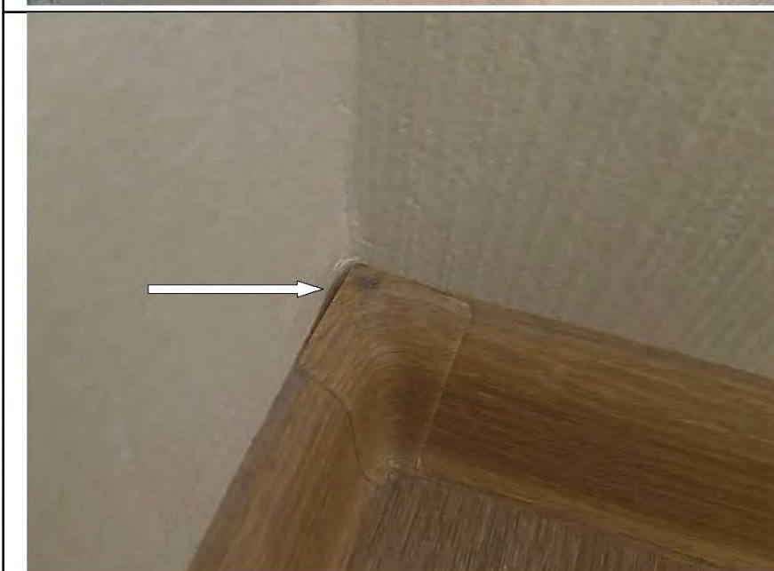
Фото №36. Дефект на напольном плинтусе ПВХ в спальне.
