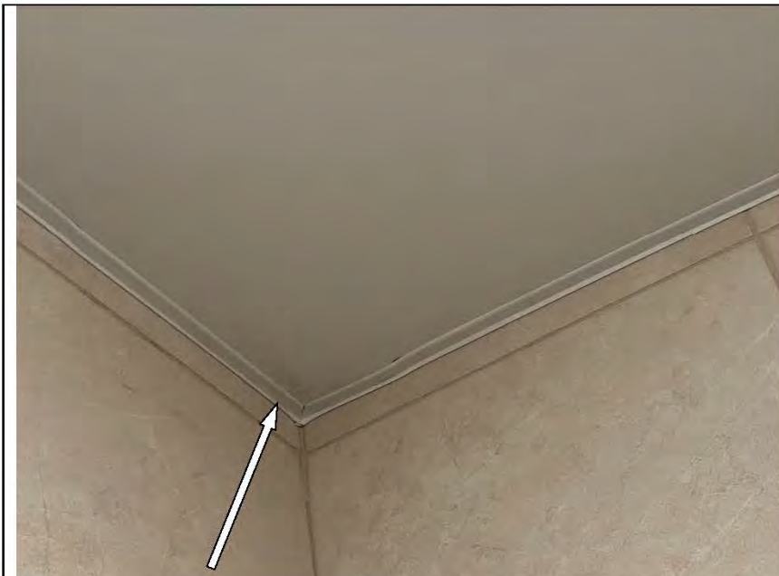
Фото №85. Дефект на поверхности натяжного потолка в санузле.
