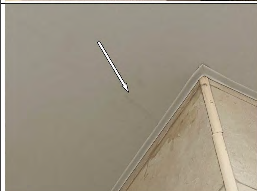
Фото №84. Дефект на поверхности натяжного потолка в ванной комнате.
