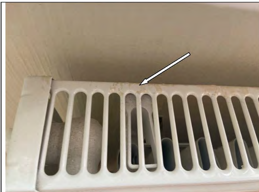
Фото №91. Дефект на поверхности металлического кожуха отопительного прибора в спальне.
