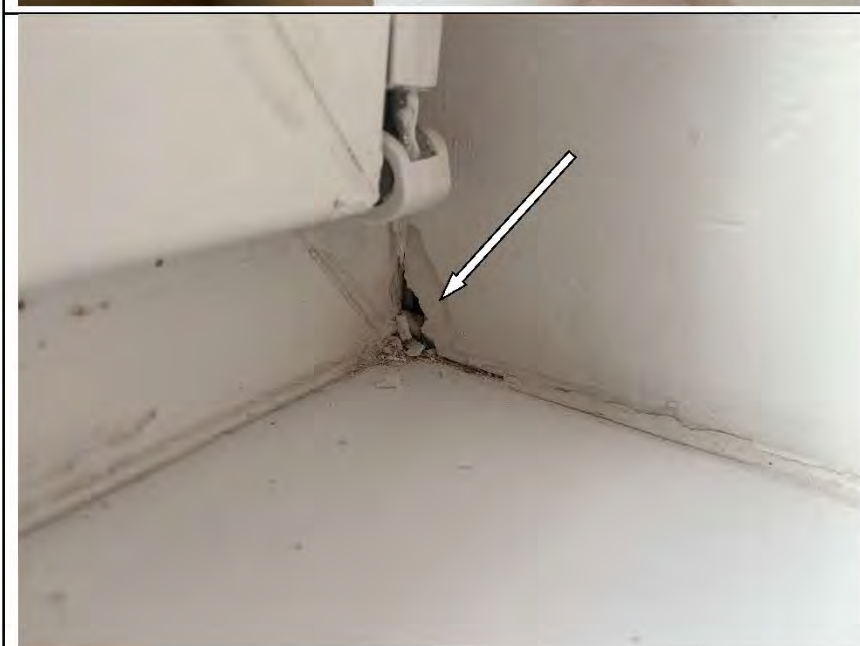
Фото №54. Неровности, выбоины, раковины на окрашенных откосах оконного блока ПВХ в спальне.
