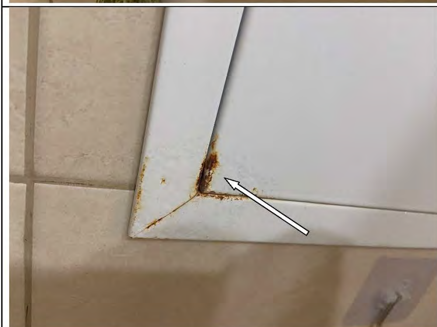
Фото №95. Коррозия на поверхности сантехнического люка в ванной комнате.
