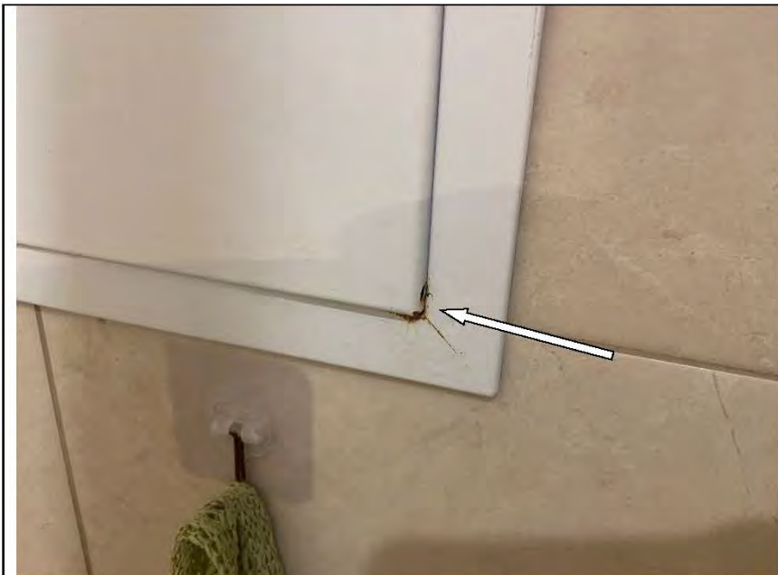
Фото №94. Коррозия на поверхности сантехнического люка в ванной комнате.
