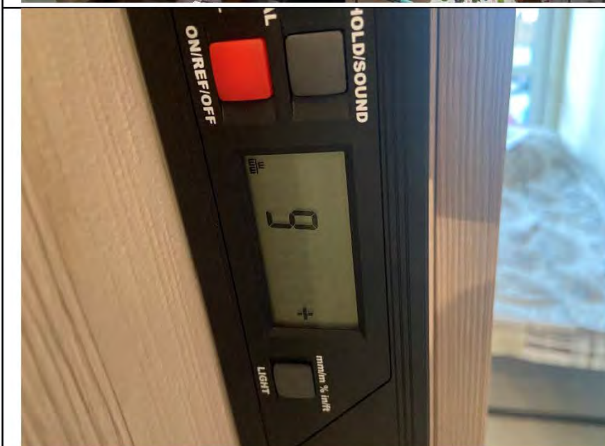
Фото №8. Отклонение поверхности стен от вертикали в коридоре.
