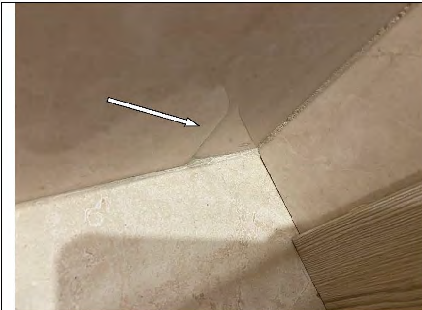
Фото №19. Трещина на настенной керамической плитке в санузле.
