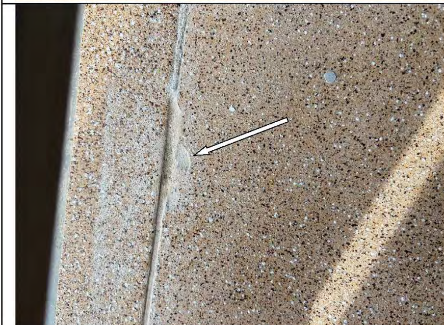
Фото №41. Скол на напольной керамической плитке на лоджии.
