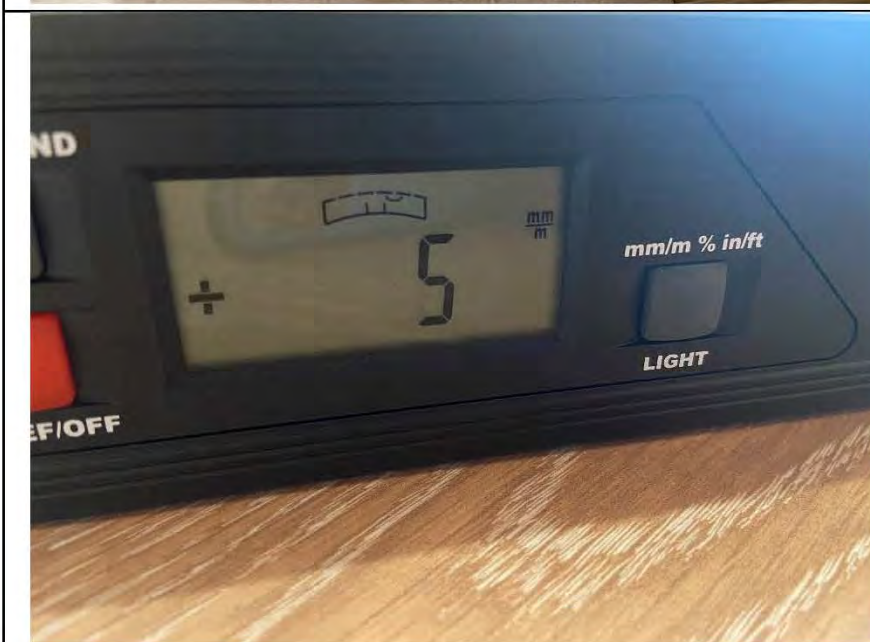
Фото №20. Отклонение поверхности напольного покрытия из ламината в коридоре.
