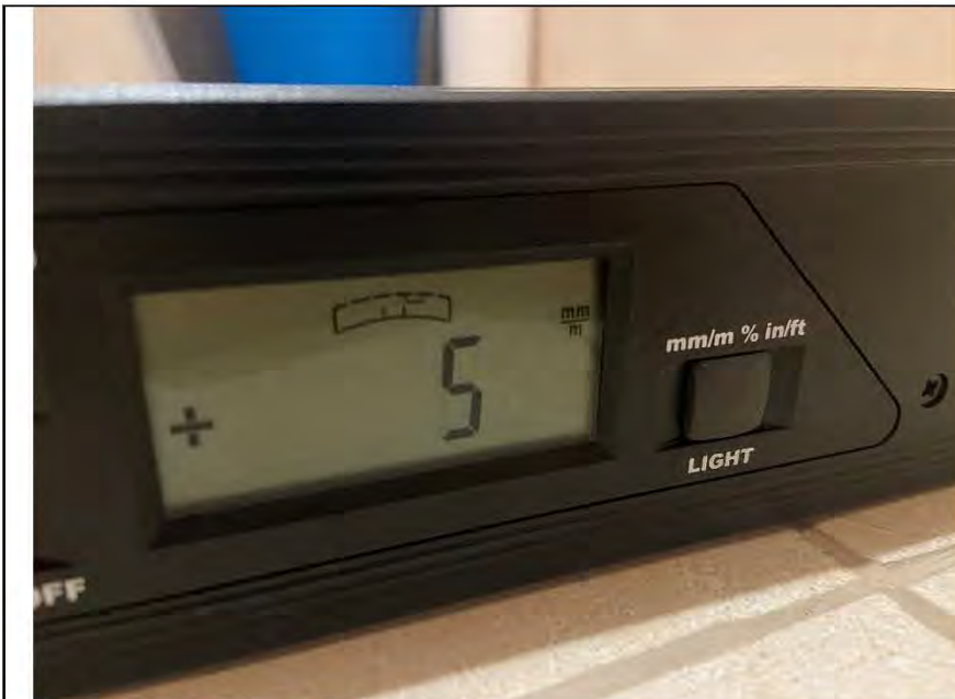
Фото №25. Отклонение поверхности напольного покрытия из керамической плитки в санузле.
