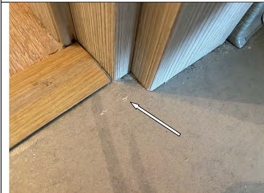
Фото №26. Загрязнения на напольной керамической плитке в кухне.
