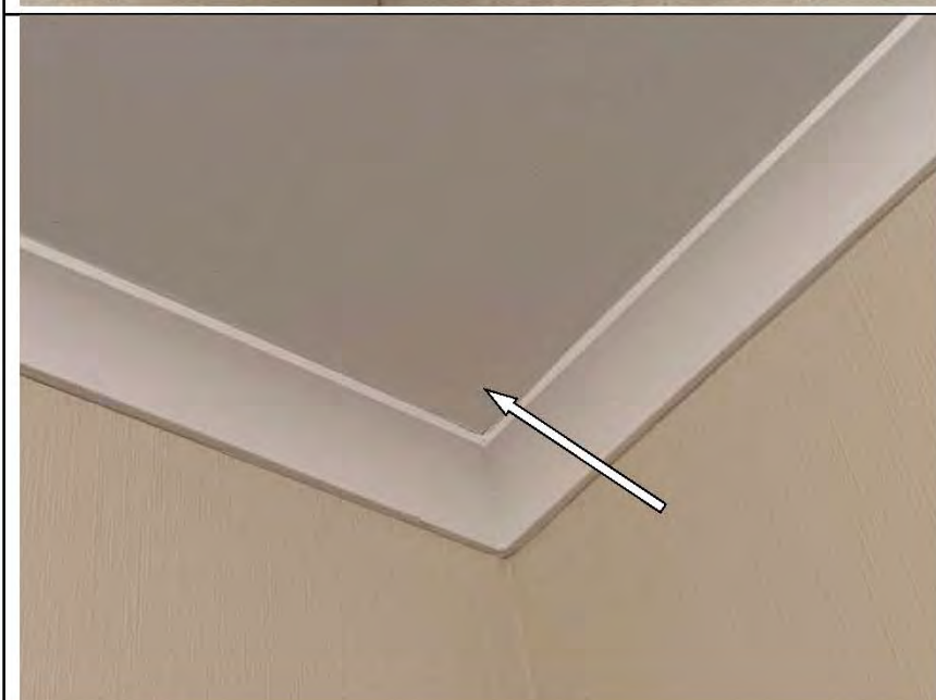
Фото №86. Дефект на поверхности окрашенного потолка в коридоре.
