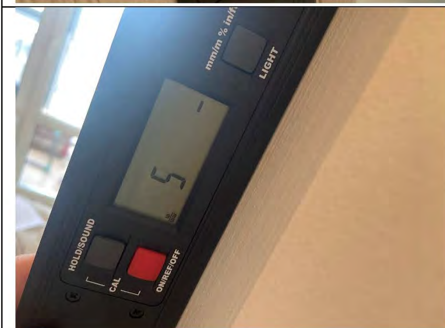
Фото №9. Отклонение поверхности стен от вертикали в кухне.
