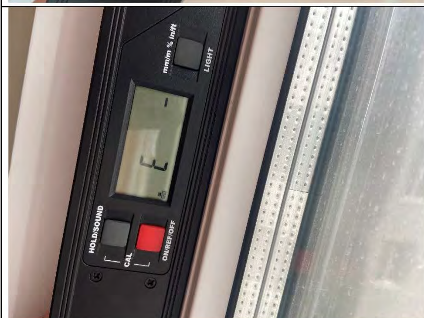
Фото №56. Отклонения от вертикали оконного блока ПВХ в спальне.
