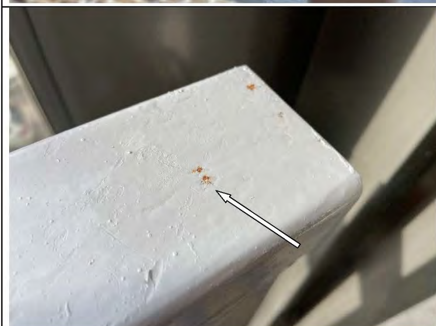
Фото №63. Дефект на металлическом ограждении на лоджии.
