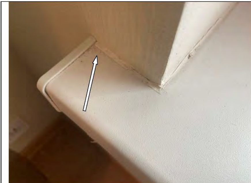
Фото №43. Дефект на лицевой стороне подоконной доски в спальне.
