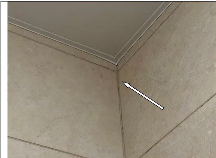
Фото №16. Неровные швы настенной керамической плитки в санузле.
