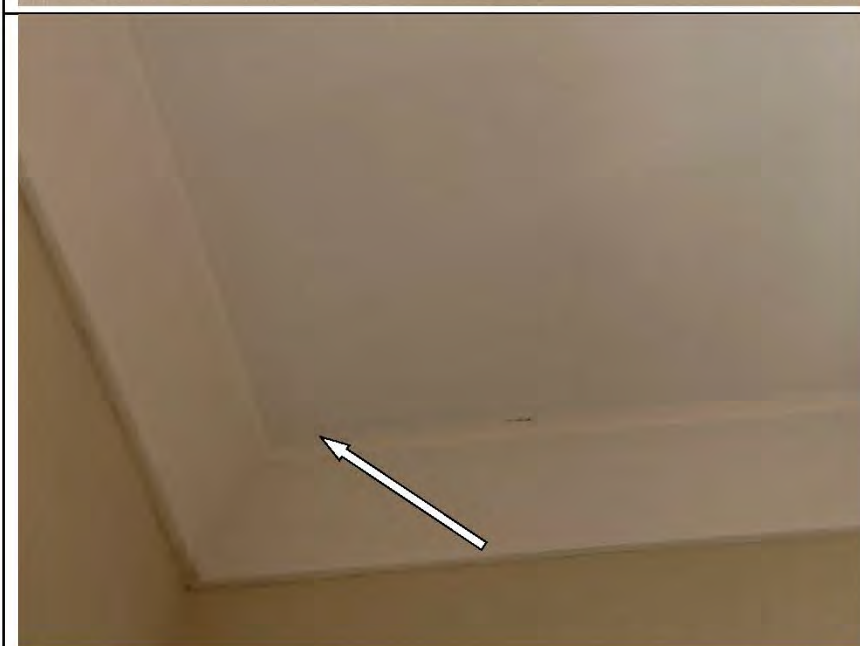
Фото №87. Дефект на поверхности окрашенного потолка в кухне.
