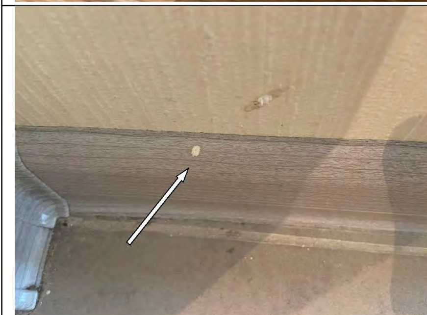
Фото №35. Дефект на напольном плинтусе ПВХ в кухне.
