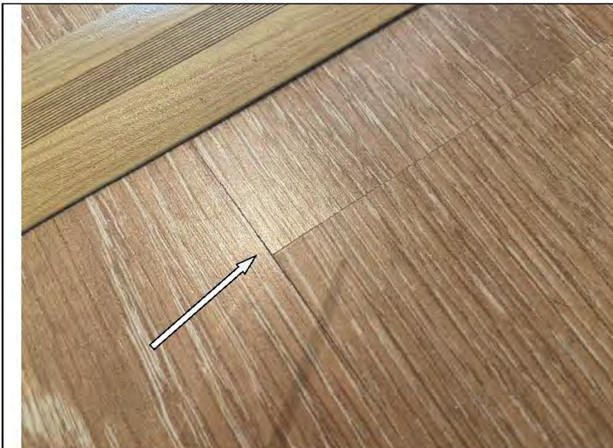
Фото №40. Поднятые кромки досок ламината в спальне.
