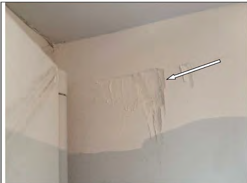
Фото №52. Неровности, выбоины, раковины на окрашенных откосах оконного блока ПВХ в кухне.
