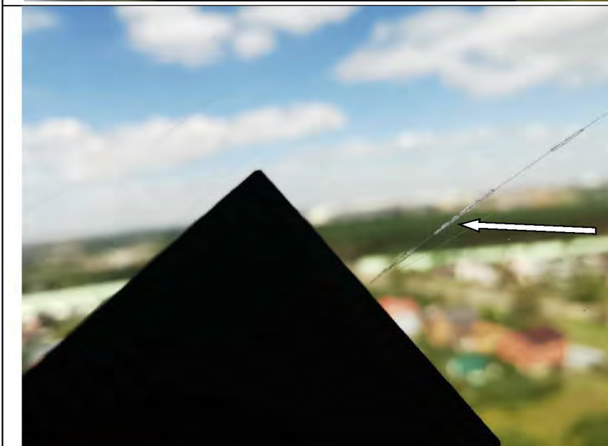
Фото №38. Царапины на стеклопакете ПВХ оконного блока в спальне.
