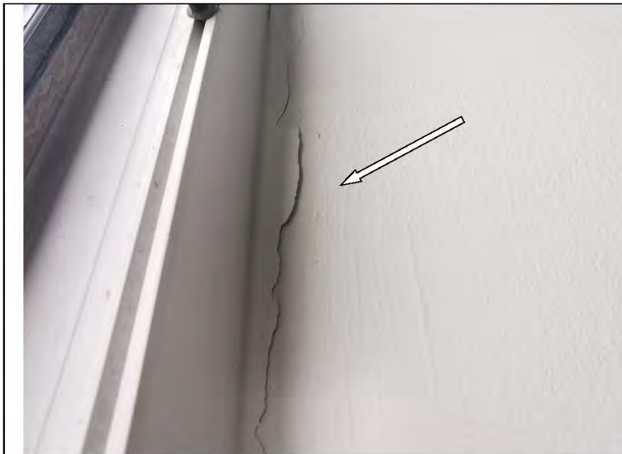
Фото №49. Окрашенные откосы оконного блока ПВХ выполнены с дефектами в спальне.
