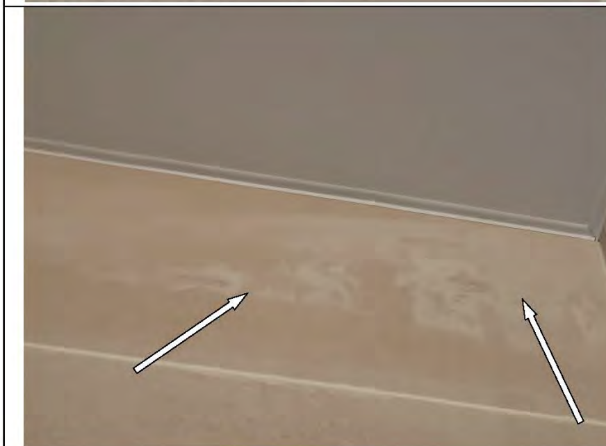
Фото №20. Загрязнение настенной керамической плитки в ванной комнате.
