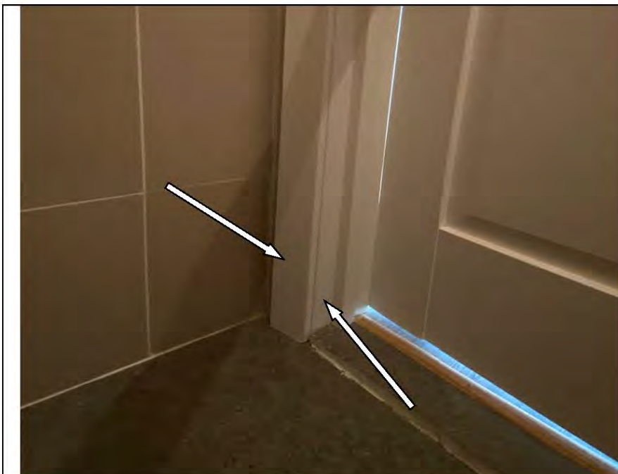
Фото №67. Конструкция дверного блока не обеспечивает безотказное открывание и закрывание двери в ванной комнате.
