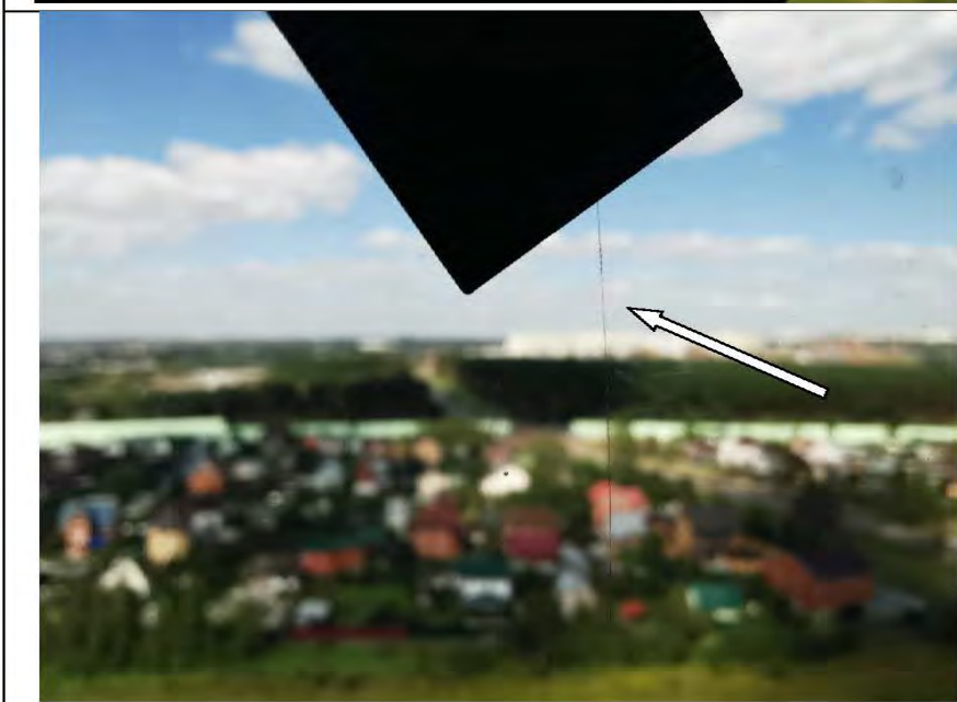
Фото №39. Царапины на стеклопакете ПВХ оконного блока в спальне.
