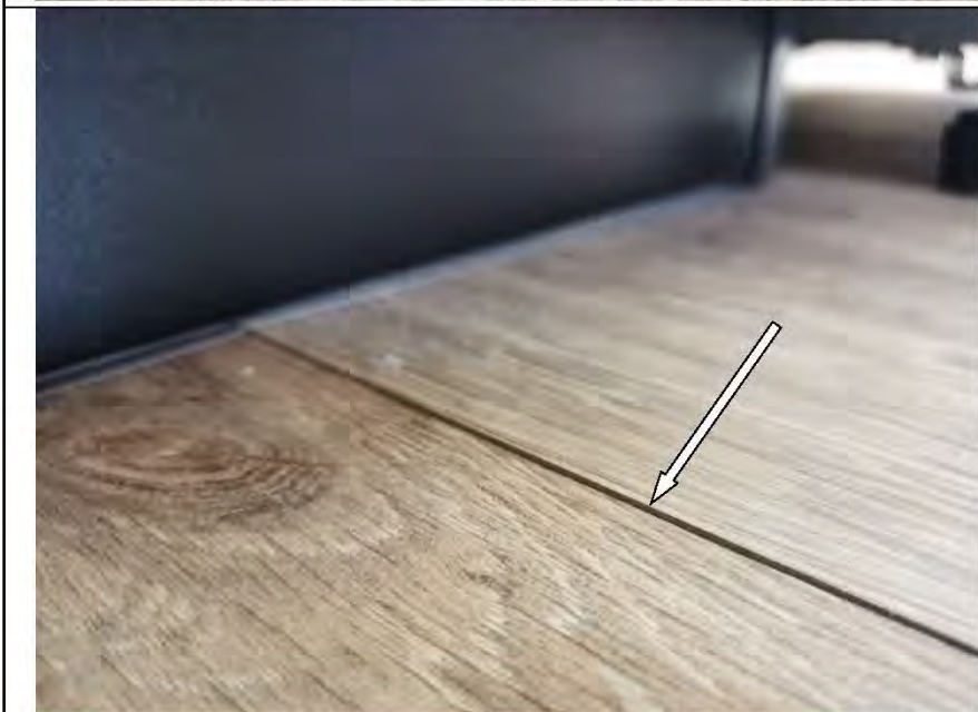
Фото №26. Уступы между соседними досками ламината в кухне.
