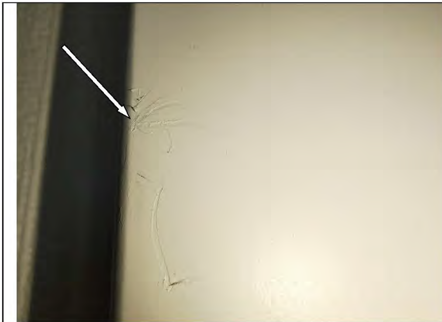
Фото №52. Царапины на полотне деревянного дверного блока в ванной комнате.
