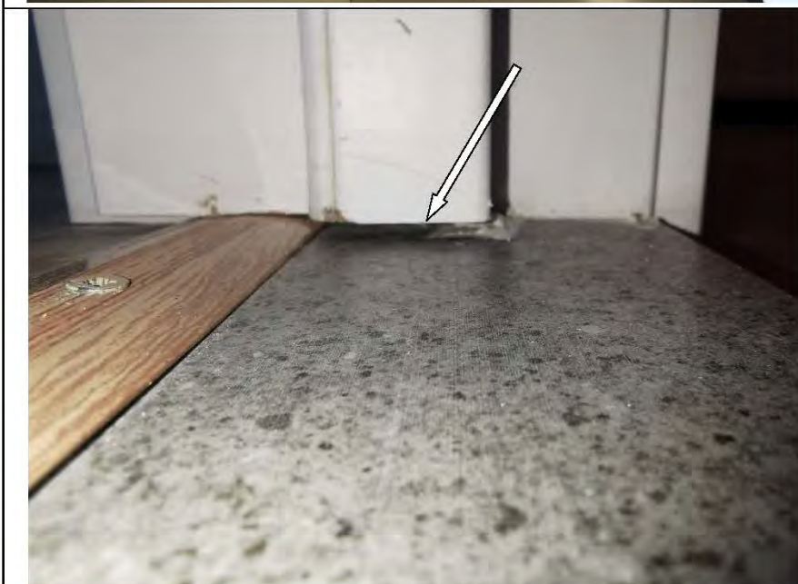
Фото №56. Коротко подрезан короб деревянного дверного блока в ванной комнате.
