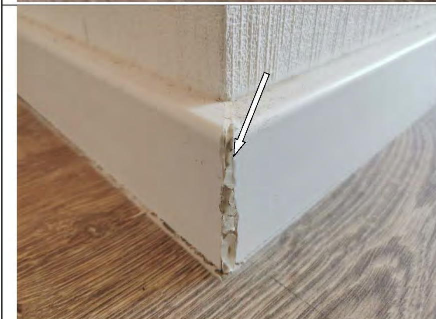
Фото №29. Деревянные напольные плинтуса имеют зазор более 0,3 мм в месте соединения элементов в кухне.
