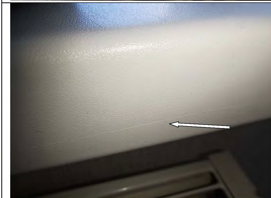
Фото №47. Царапины на лицевой поверхности подоконной доски в спальне.
