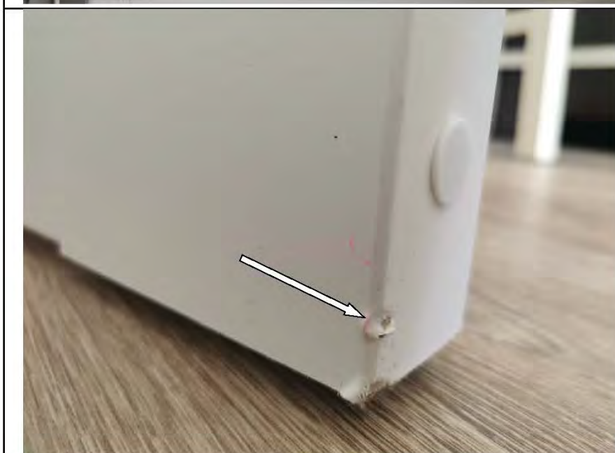
Фото №51. Потертости на полотне деревянного дверного блока в ванной комнате.
