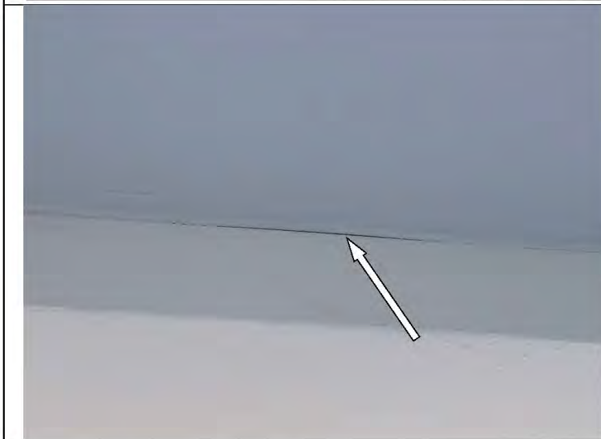
Фото №33. Дефект монтажа декоративного молдинга крепления натяжного потолка в спальне.
