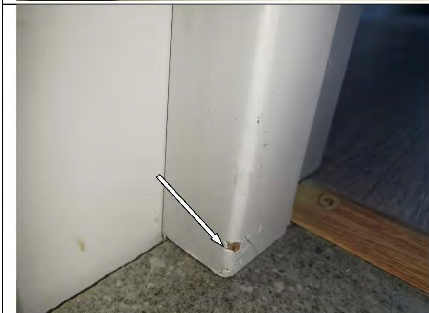
Фото №53. Потертости на коробе деревянного дверного блока в ванной комнате.
