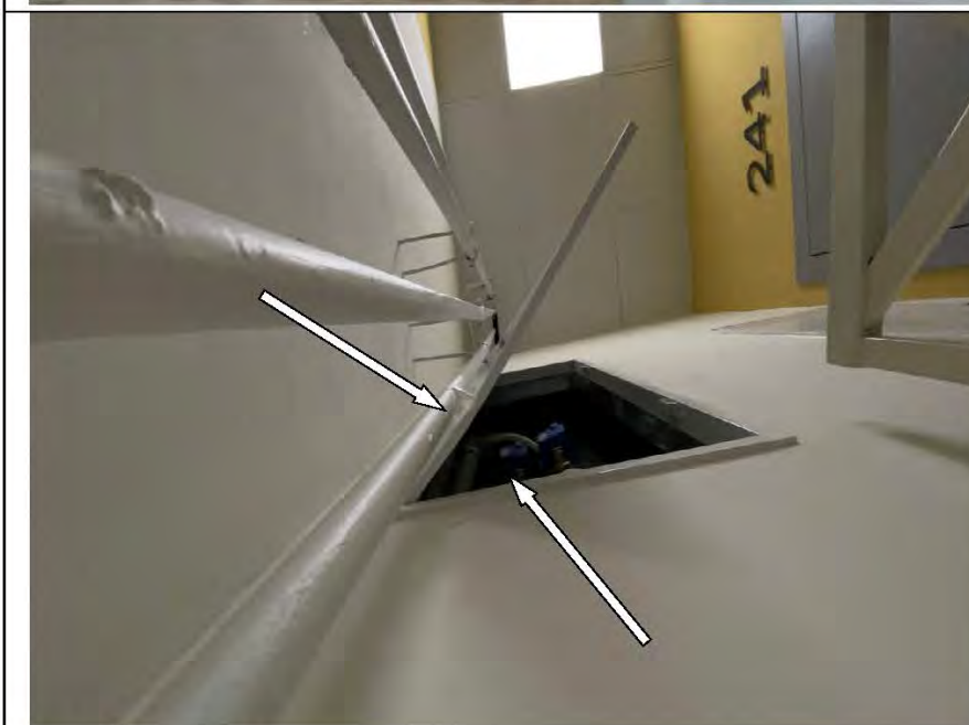
Фото №66. Ревизионный люк в коридоре не обеспечивает полноценный доступ к коммуникациям.
