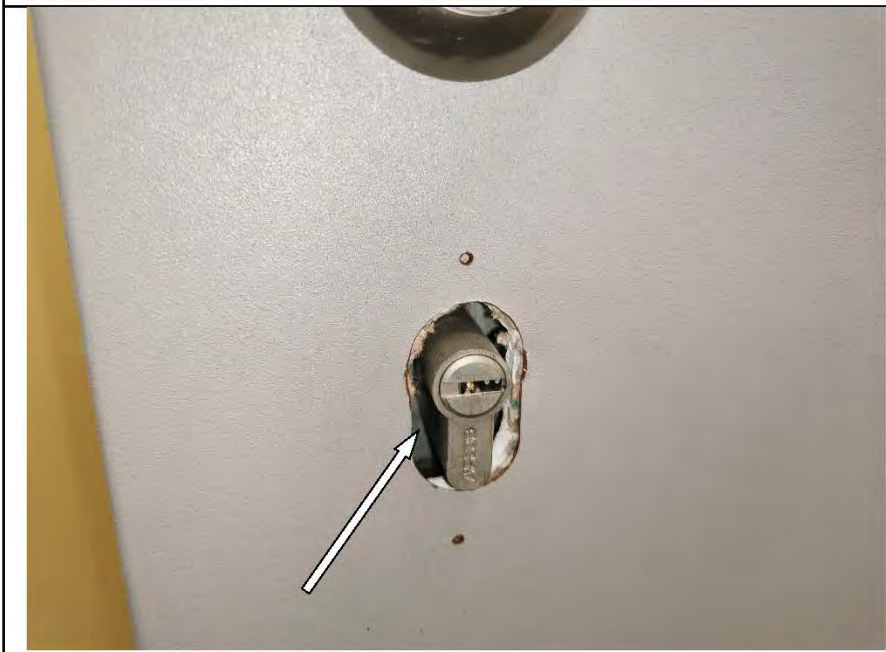
Фото №59. Загрязнения на полотне входного дверного блока.
