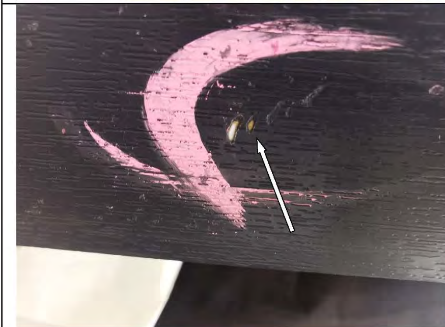
Фото №41. Потертости на профиле ПВХ оконного блока в спальне.
