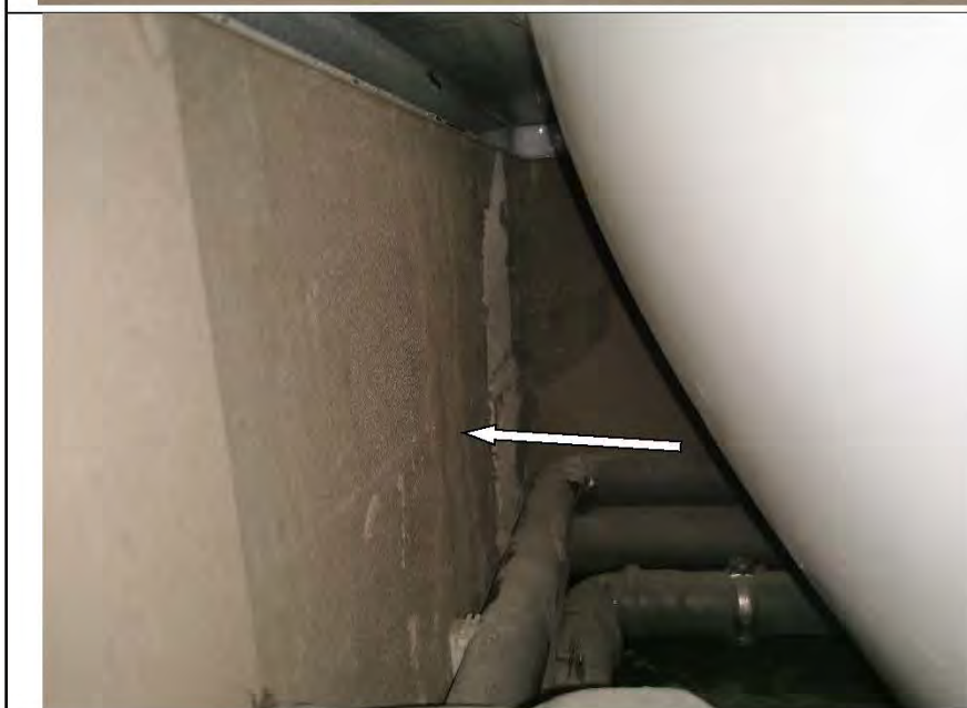
Фото №21. Частично отсутствует настенная керамическая плитка за ванной.
