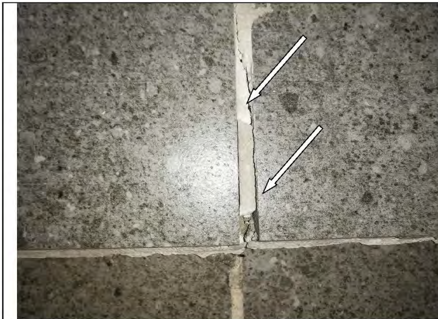
Фото №31. Неполное заполнение шовного пространства затирачным составом в ванной комнате.
