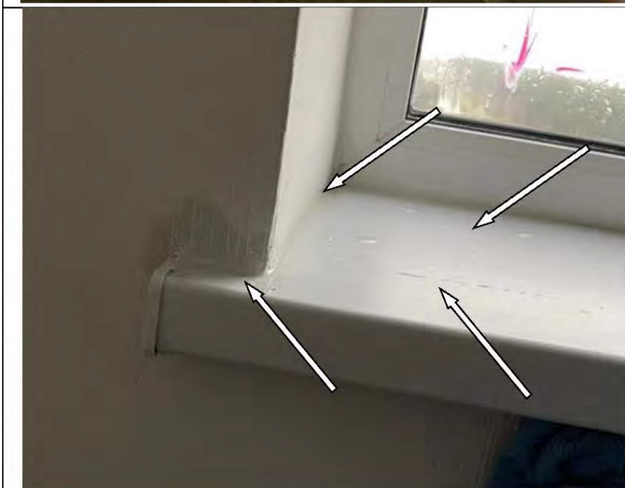
Фото №68. Оконный блок в спальне имеет щели, через которые происходит инфильтрация воздуха и влаги внутрь помещения.
