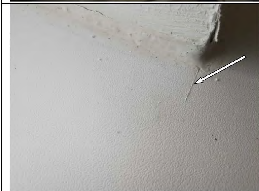
Фото №48. Царапины на лицевой поверхности подоконной доски в кухне.
