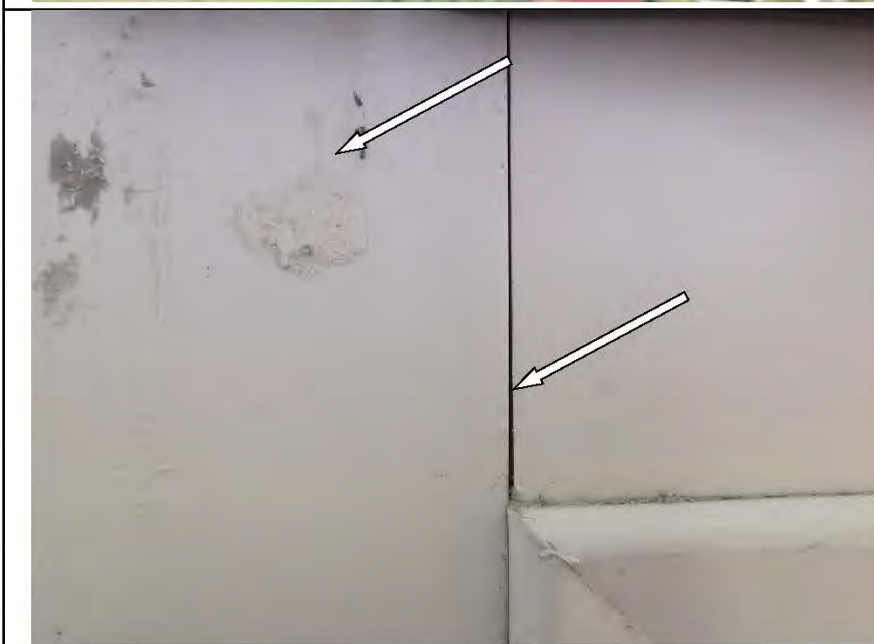
Фото №45. Зазоры и загрязнение профиля ПВХ оконного блока в кухне.
