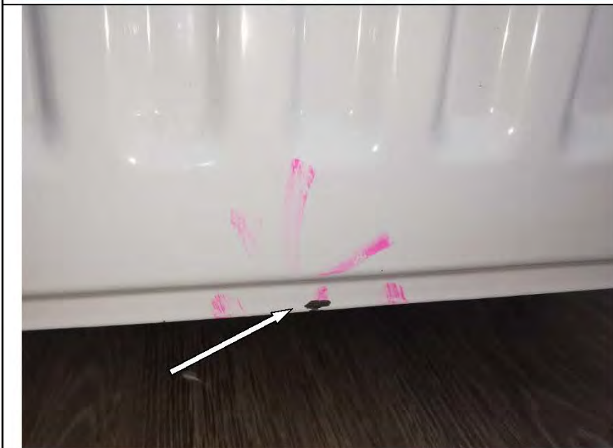
Фото №62. Потертости на радиаторе в спальне.
