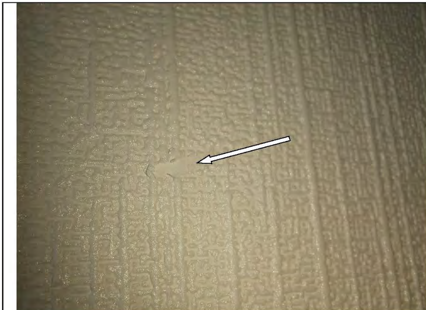
Фото №13. Потертости обойного полотна в спальне.
