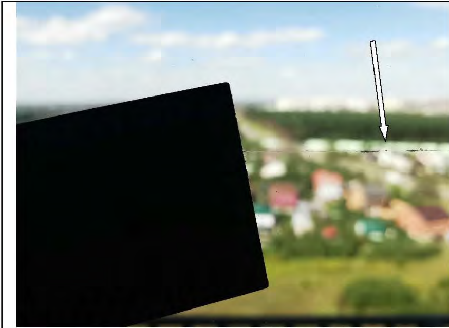
Фото №40. Царапины на стеклопакете ПВХ оконного блока в кухне.
