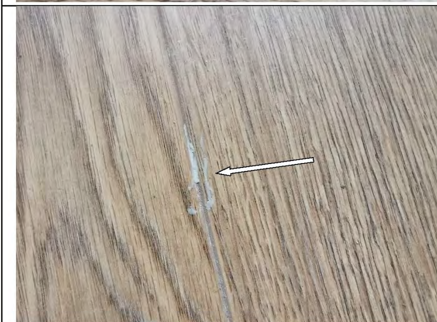
Фото №18. Загрязнения на поверхности ламината в коридоре.
