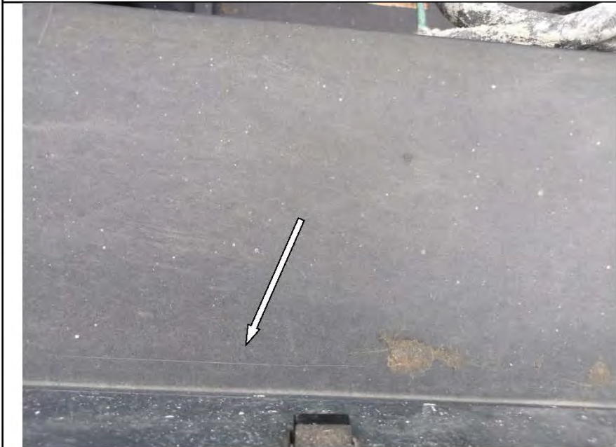
Фото №41. Царапины на металлическом отливе оконного блока в комнате.
