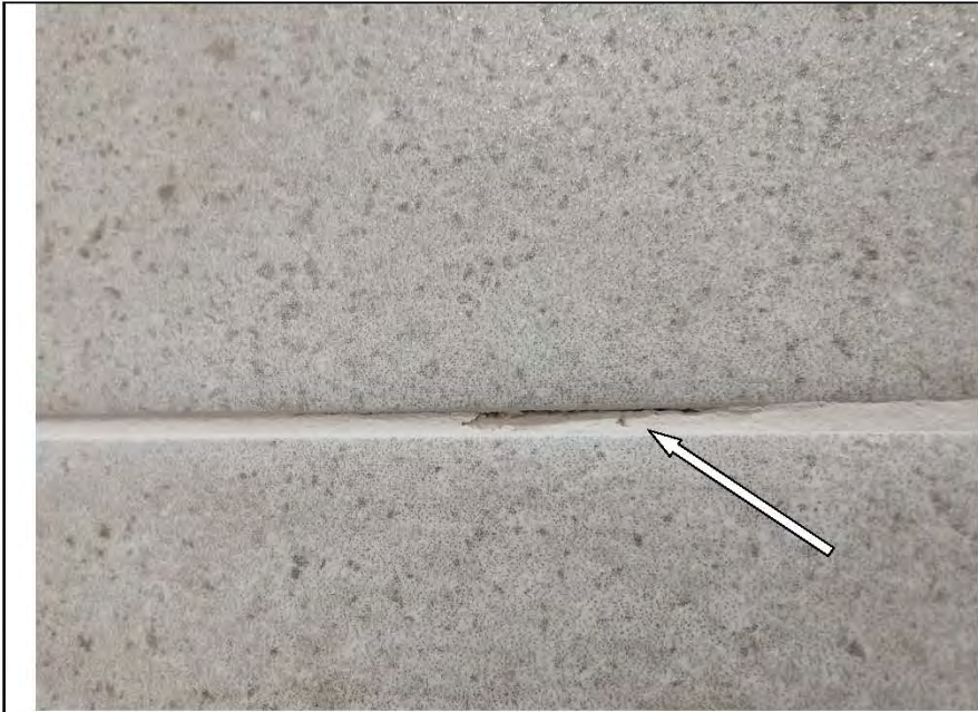
Фото №13. Неполное заполнение швов настенной керамической плитки в ванной комнате.
