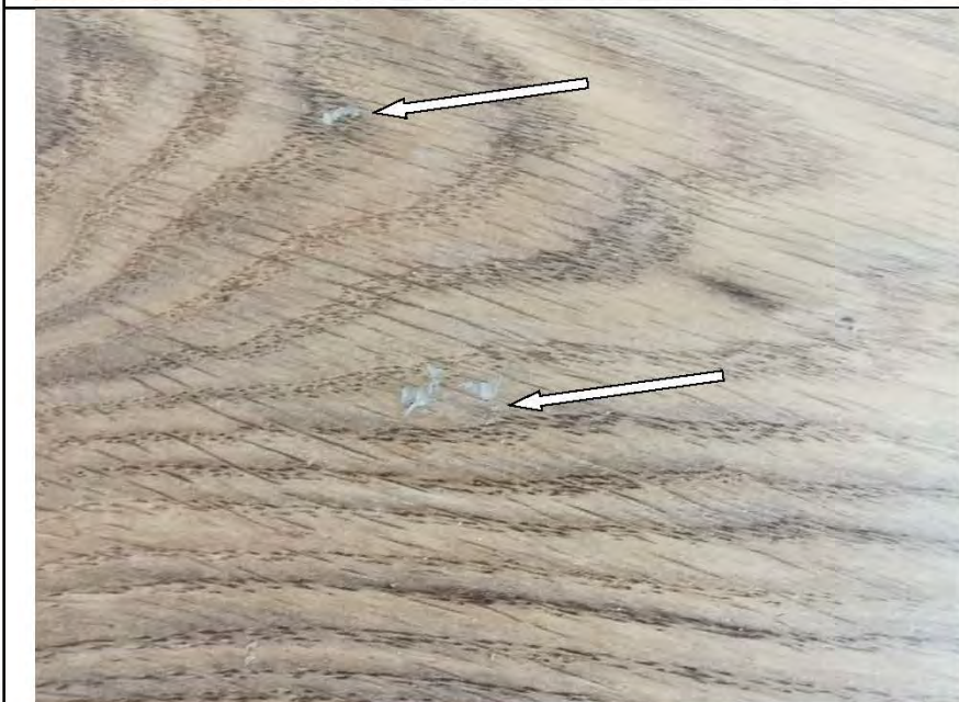
Фото №17. Загрязнения на поверхности ламината в коридоре.
