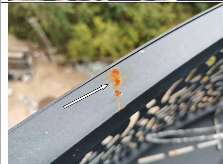
Фото №54. Коррозия на металлическом ограждении в месте установки кондиционера.
