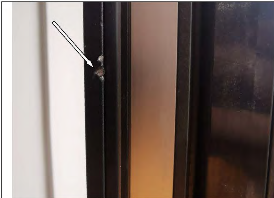
Фото №37. Замытие на профиле металлического оконного блока в комнате.
