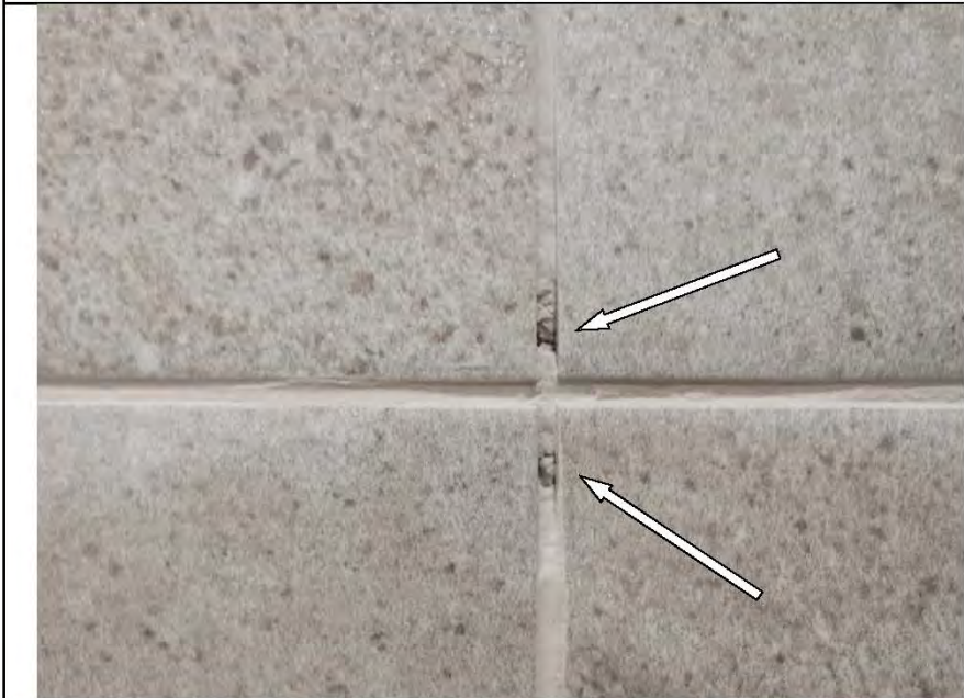
Фото №14. Неполное заполнение швов настенной керамической плитки в ванной комнате.
