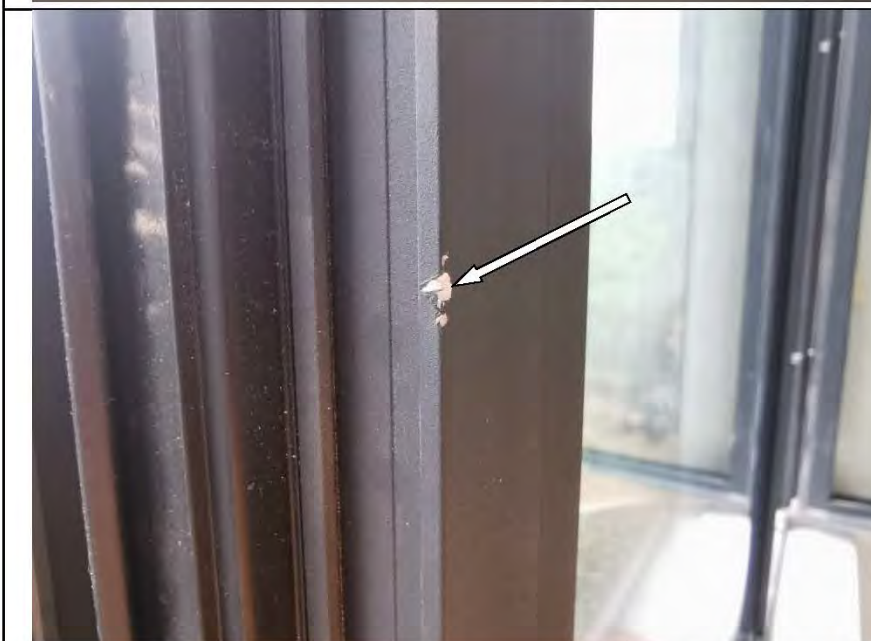
Фото №36. Замятие на профиле металлического оконного блока в комнате.
