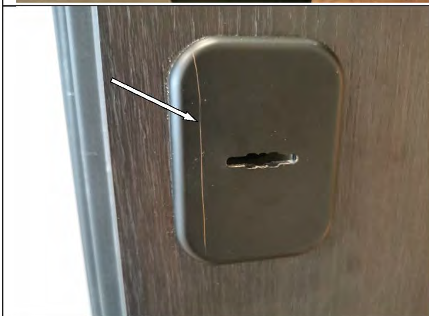
Фото №51. Царапины на фурнитуре входного дверного блока.
