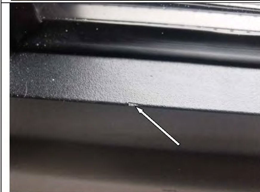
Фото №35. Замятие на профиле металлического оконного блока в комнате.
