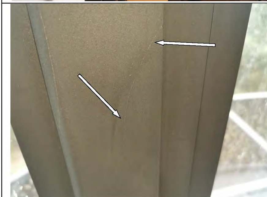
Фото №38. Царапины на профиле металлического оконного блока в комнате.
