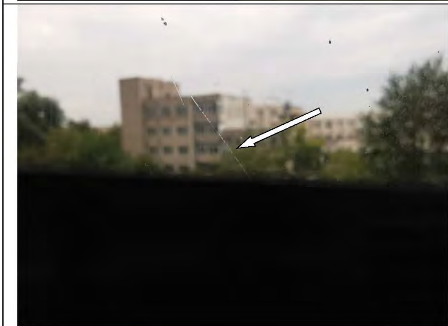
Фото №32. Царапины на стеклопакете металлического оконного блока в комнате.
