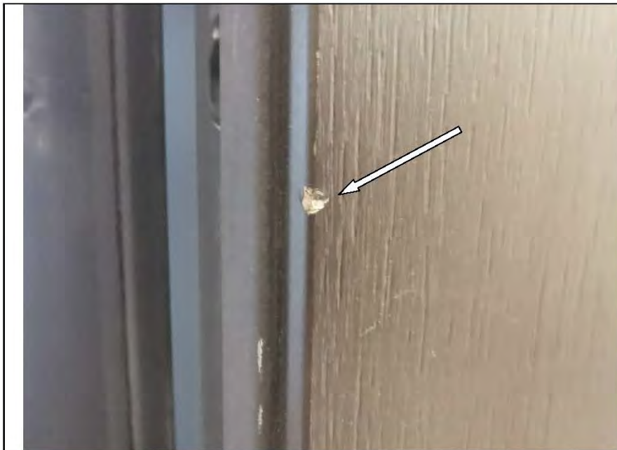
Фото №49. Замытие на деревянном наличнике входного дверного блока.
