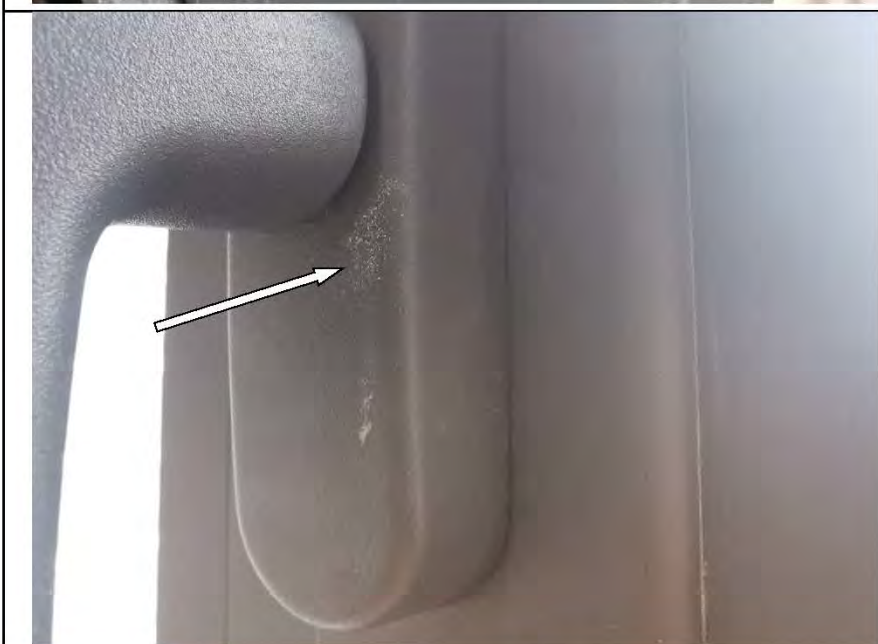
Фото №44. Загрязнение фурнитуры металлического оконного блока в комнате.
