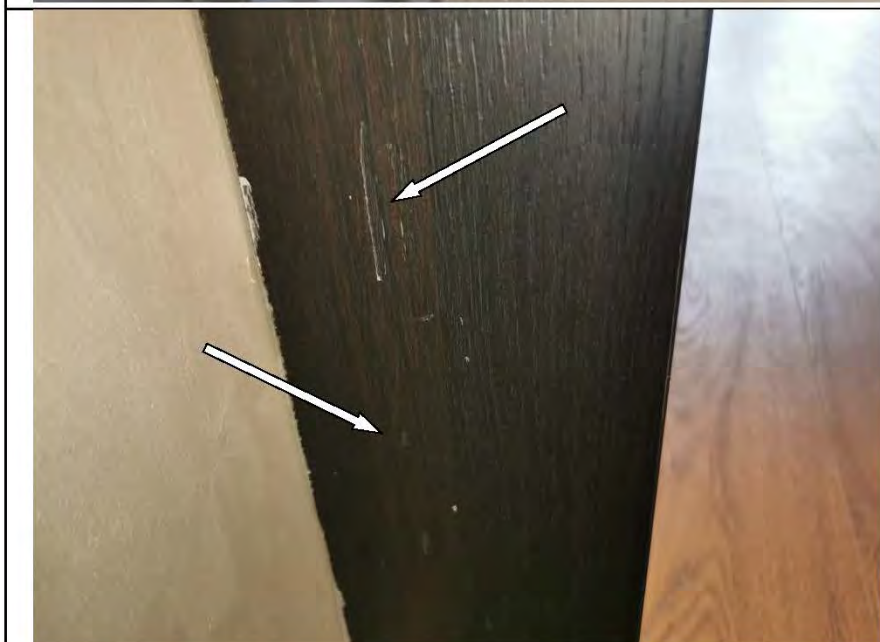
Фото №50. Загрязнение на деревянном наличнике входного дверного блока.
