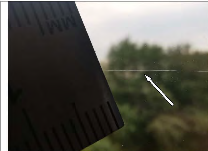
Фото №28. Царапины на стеклопакете металлического оконного блока в комнате.
