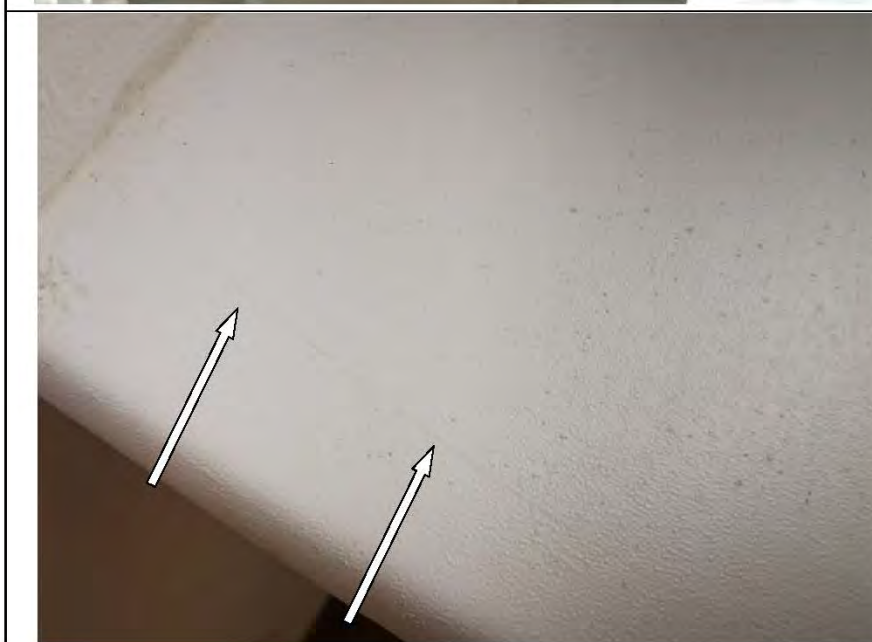
Фото №39. Царапины на лицевой поверхности подоконной доски в комнате.
