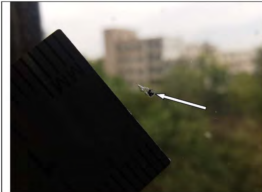
Фото №31. Скол на стеклопакете металлического оконного блока в комнате.
