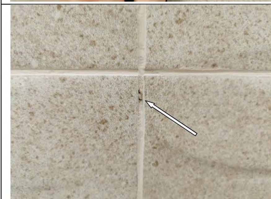
Фото №12. Неполное заполнение швов настенной керамической плитки в ванной комнате.
