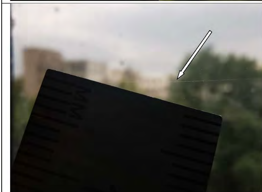
Фото №27. Царапины на стеклопакете металлического оконного блока в комнате.
