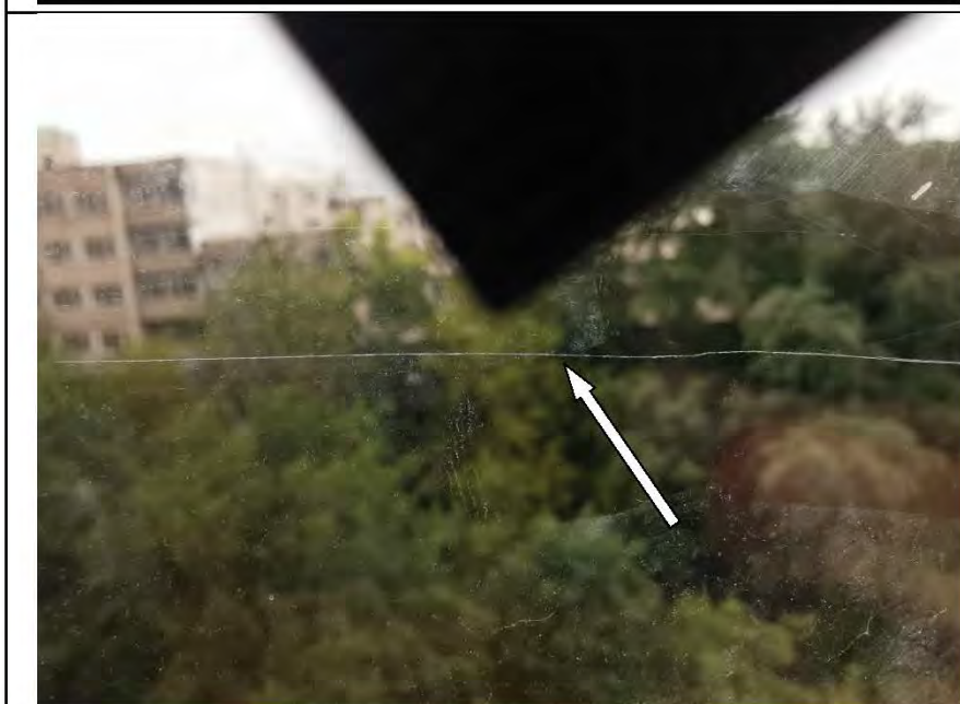
Фото №33. Царапины на стеклопакете металлического оконного блока в комнате.
