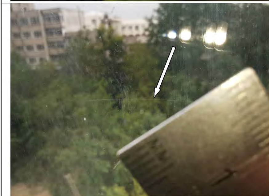
Фото №29. Царапины на стеклопакете металлического оконного блока в комнате.
