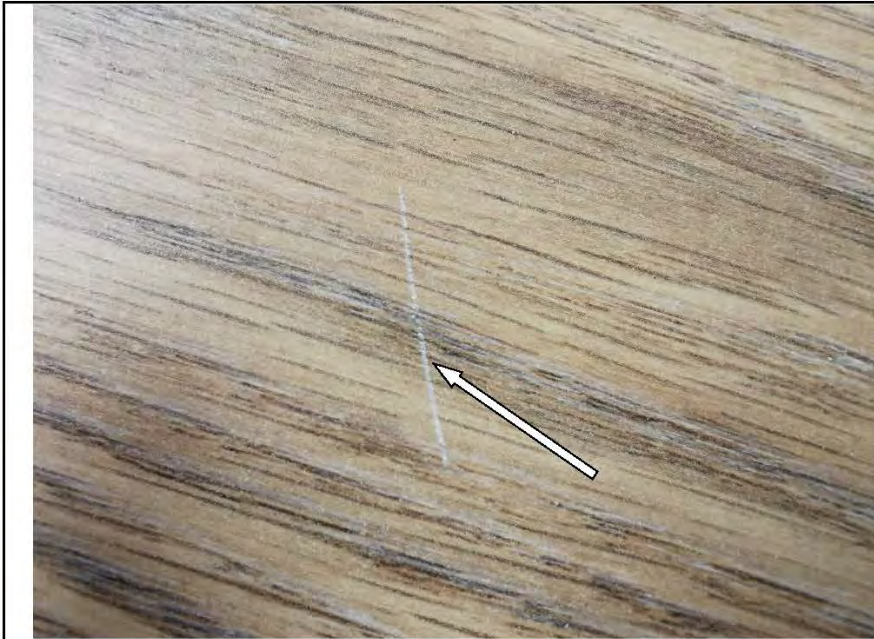
Фото №22. Царапины на поверхности ламината в комнате.
