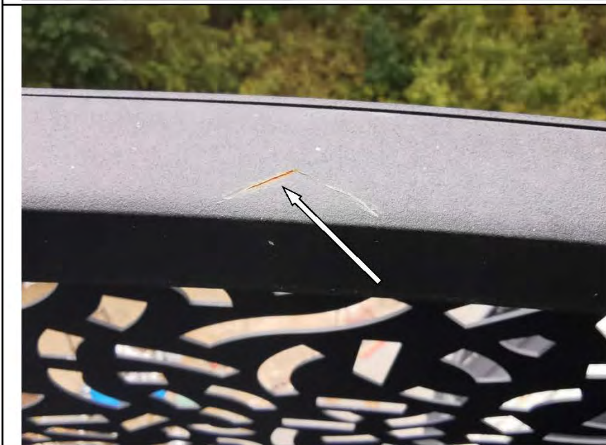
Фото №53. Коррозия на металлическом ограждении в месте установки кондиционера.
