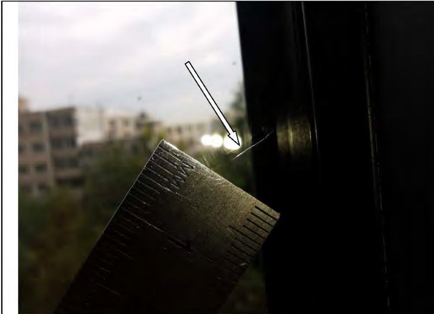
Фото №34. Царапины на стеклопакете металлического оконного блока в комнате.
