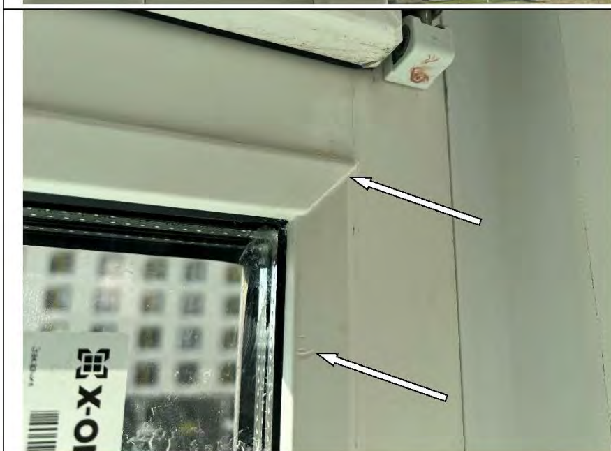
Фото №30. Зазоры в стыках профиля ПВХ оконного блока в спальне. Механические повреждения профиля ПВХ оконного блока в спальне.
