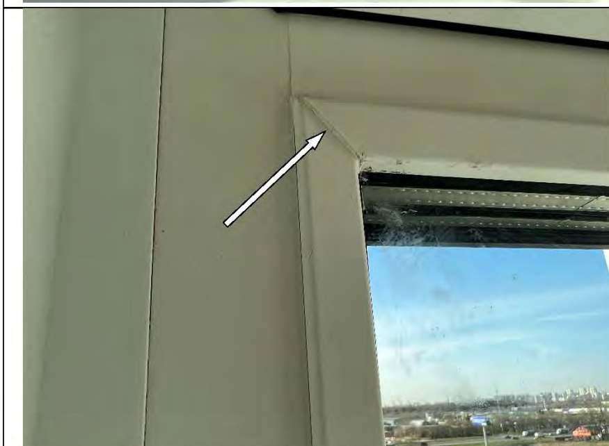
Фото №29. Зазоры в стыках профиля ПВХ оконного блока в спальне.
