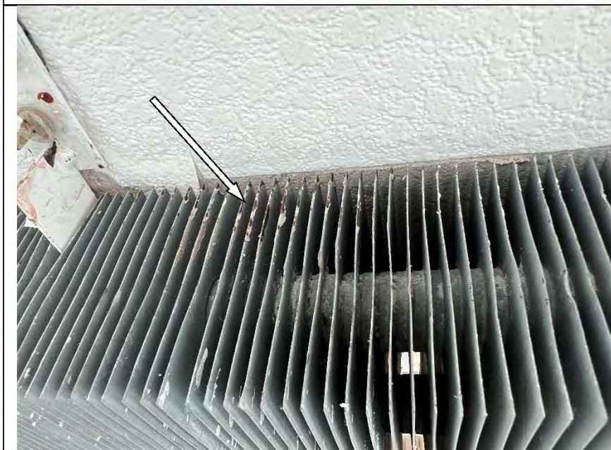
Фото №50. Коррозия и загрязнение сот радиатора в спальне.
