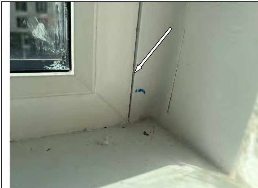
Фото №28. Зазор между нащельником и рамой оконного блока в кухне.
