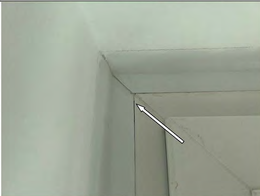
Фото №26. Зазор между нащельником и рамой оконного блока в спальне.
