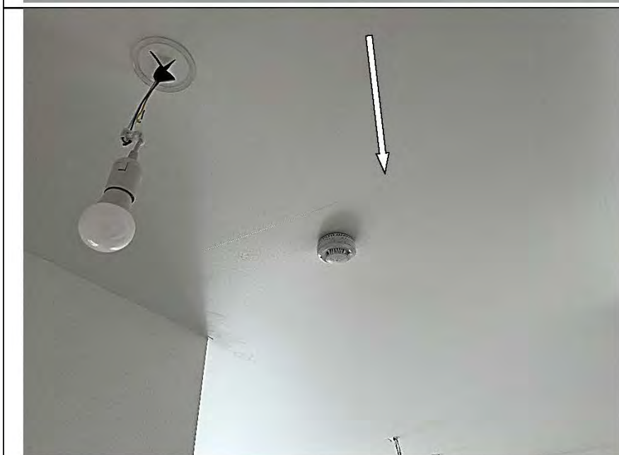
Фото №35. Механическое повреждения полотна натяжного потолка в прихожей.
