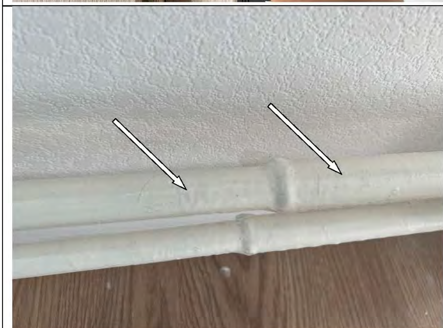
Фото №48. Подтеки краски на трубах отопления в спальне.
