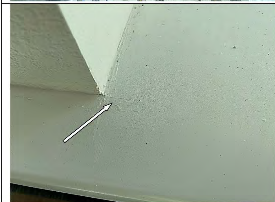
Фото №33. Царапина на лицевой поверхности подоконной доски в спальне.
