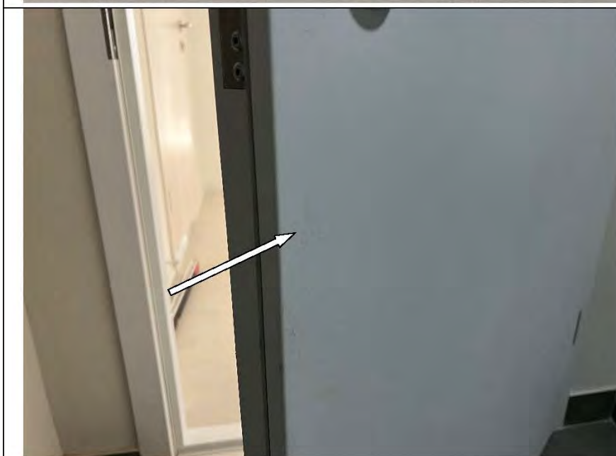
Фото №39. Механические повреждения полотна входного дверного блока.
