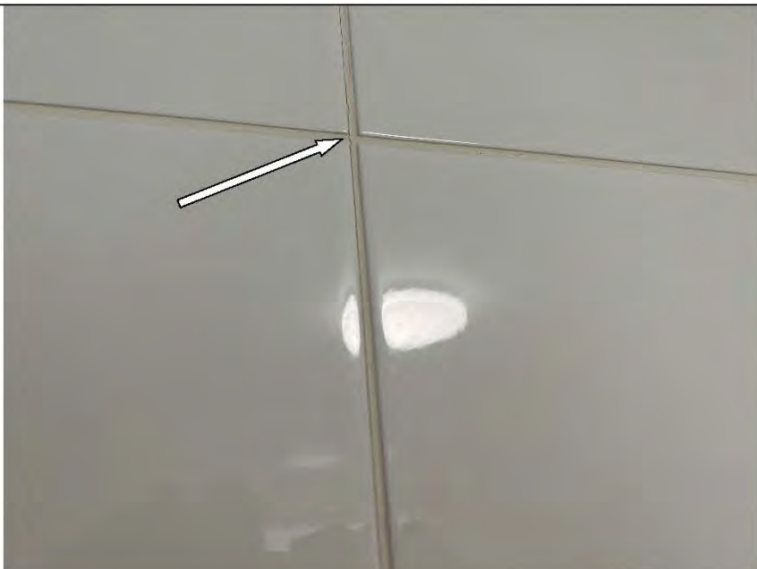
Фото №19. Трещина затирочного слоя настенной плитки в ванной комнате.
