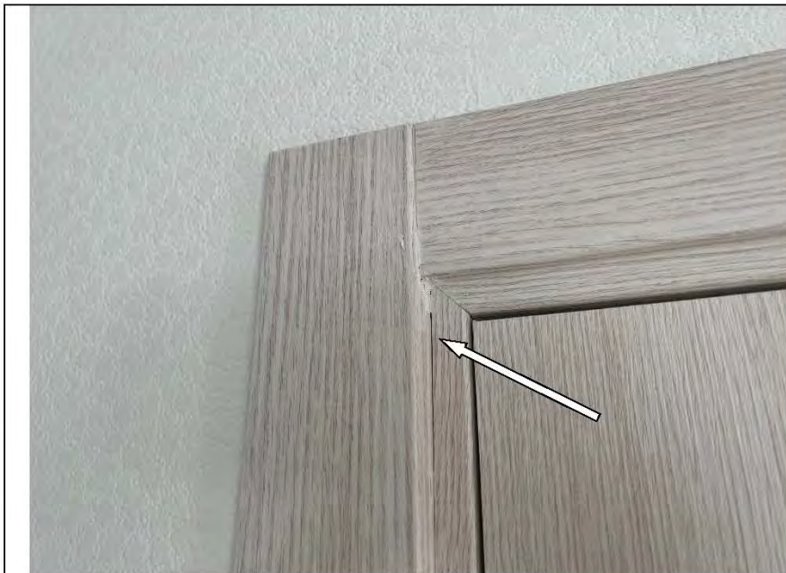
Фото №43. Элементы дверного блока в ванной комнате соединены не надежно (коробка).
