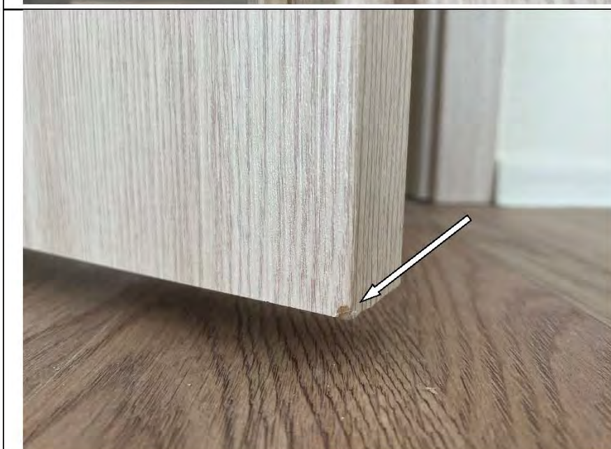
Фото №45. Механическое повреждение лицевой поверхности полотна дверного блока в спальне.
