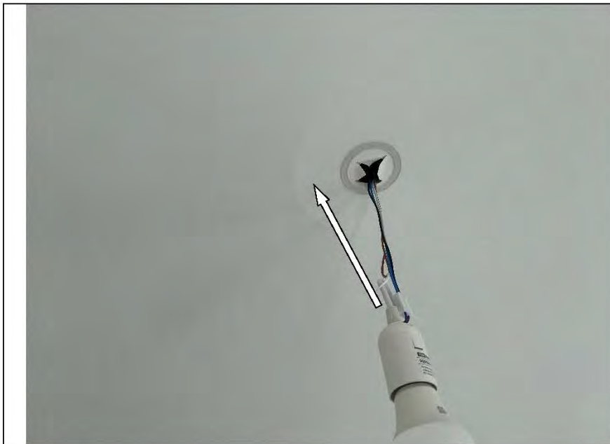
Фото №37. Видимые закладные детали на поверхности полотна натяжного потолка в спальне.
