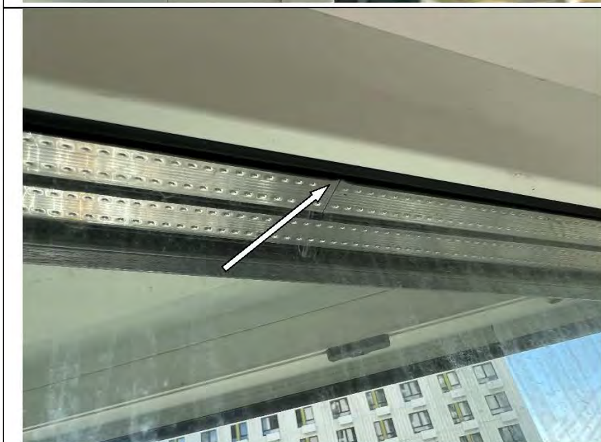
Фото №32. Замятие уплотнительной ленты на профиле ПВХ оконного блока в кухне.
