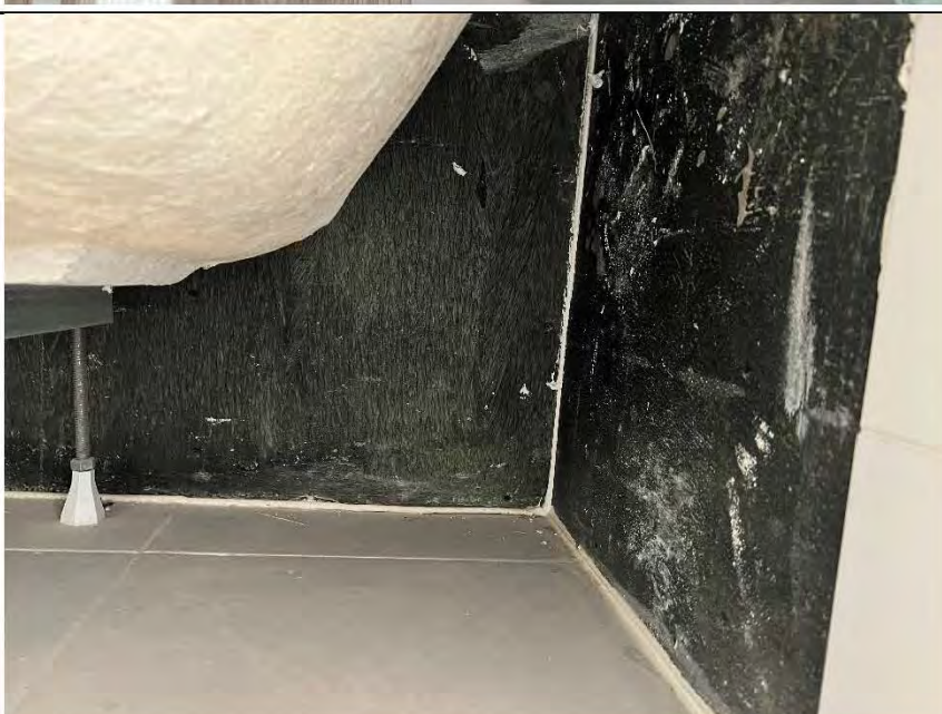
Фото №18. Частично отсутствует настенная плитка за ванной.
