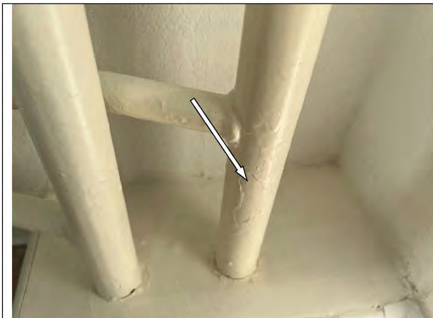
Фото №49. Подтеки краски на трубах отопления в кухне.
