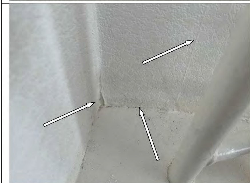
Фото №14. Загрязнение и отслоение обойного полотна в спальне. Читаемые обойные стыки в спальне.
