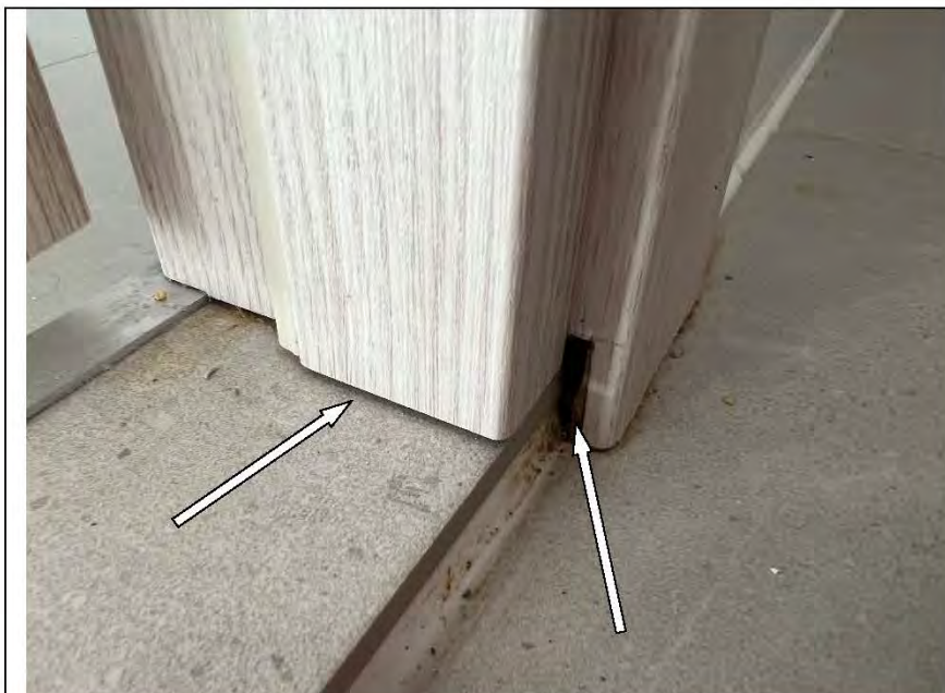
Фото № 52. Короткая подрезка наличников и дверного короба в ванной комнате.
