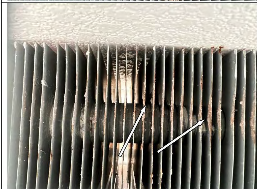
Фото №51. Коррозия и загрязнение сот радиатора в кухне.
