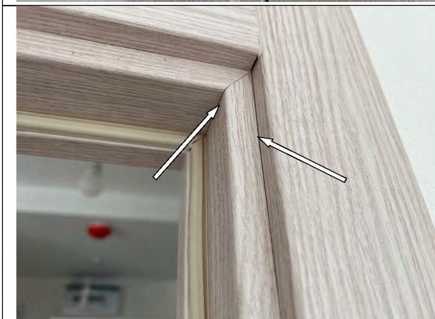
Фото №44. Элементы дверного блока в спальне соединены не надежно (коробка).
