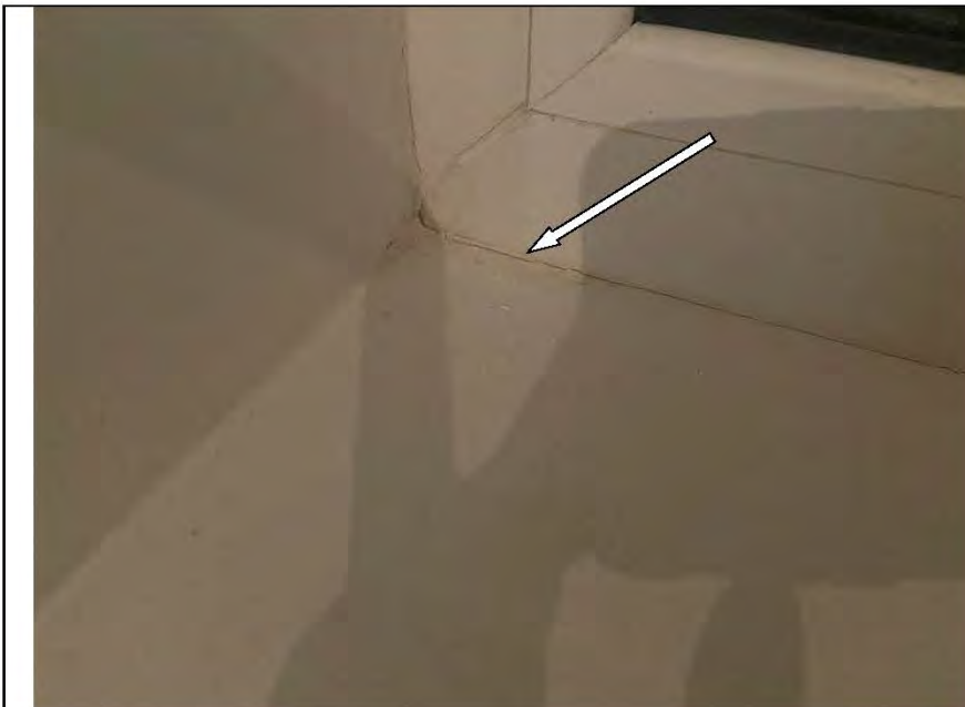
Фото №28. Дефект на лицевой стороне подоконной доски оконного блока ПВХ в спальне.
