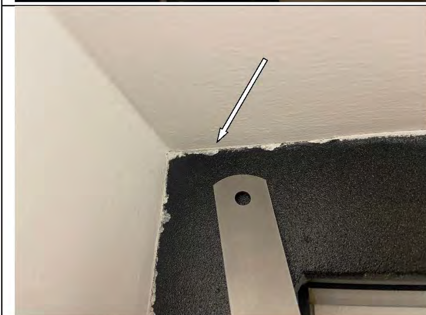
Фото №39. Дефект на коробке входного дверного блока в коридоре.
