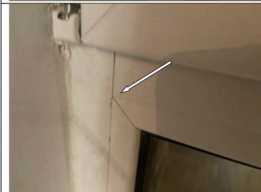
Фото №29. Дефект на профиле оконного блока ПВХ в кухне.
