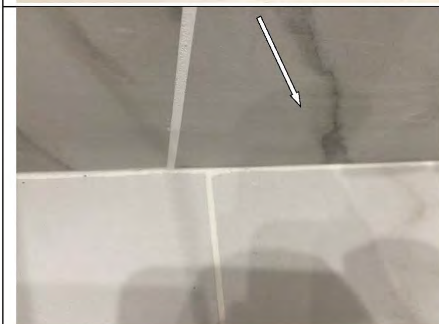
Фото №17. Загрязнения на напольной керамической плитке в ванной комнате.
