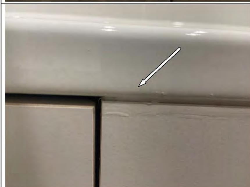
Фото №56. Загрязнения на ванне в ванной комнате.
