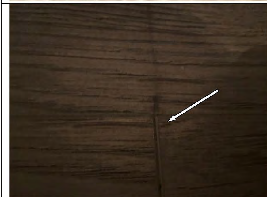
Фото №26. Поднятые кромки досок ламината в спальне.
