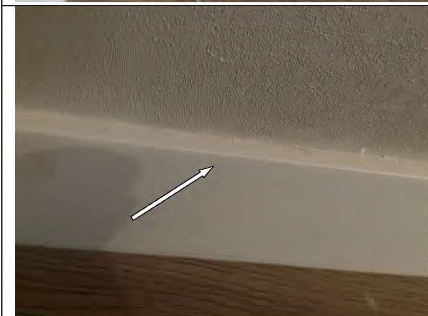
Фото №21. Дефект на напольном деревянном плинтусе в спальне.
