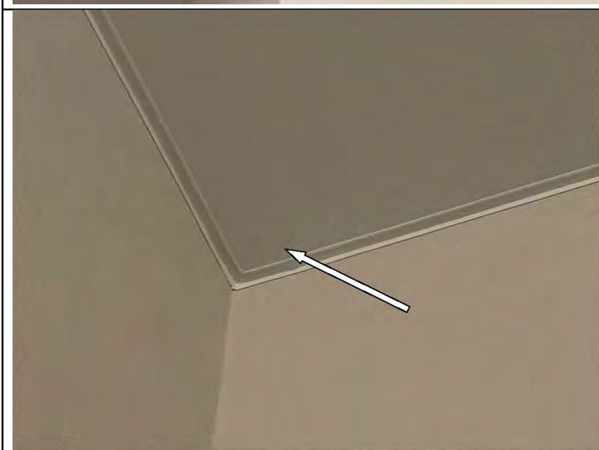
Фото №51. Дефект на поверхности натяжного потолка в кухне.
