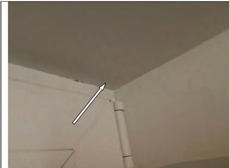
Фото №34. Неровности, выбоины, раковины на окрашенных откосах оконного блока ПВХ в спальне.
