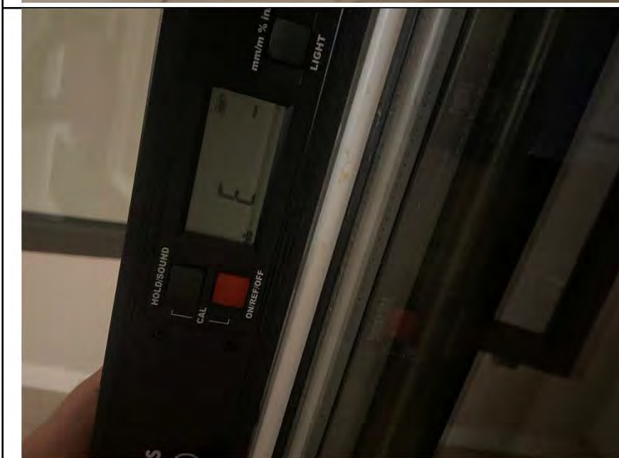
Фото №35. Отклонение от вертикали оконного блока ПВХ в кухне.
