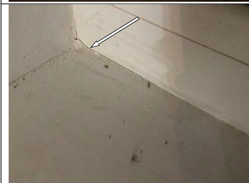
Фото №27. Дефект на лицевой стороне подоконной доски оконного блока ПВХ в кухне.
