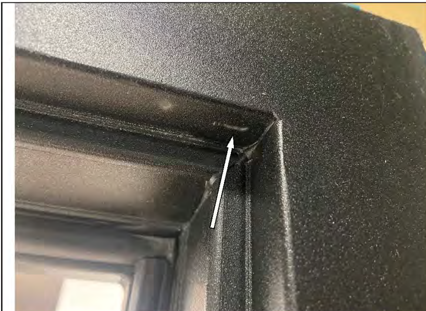
Фото №43. Дефект на наличниках входного дверного блока в коридоре.
