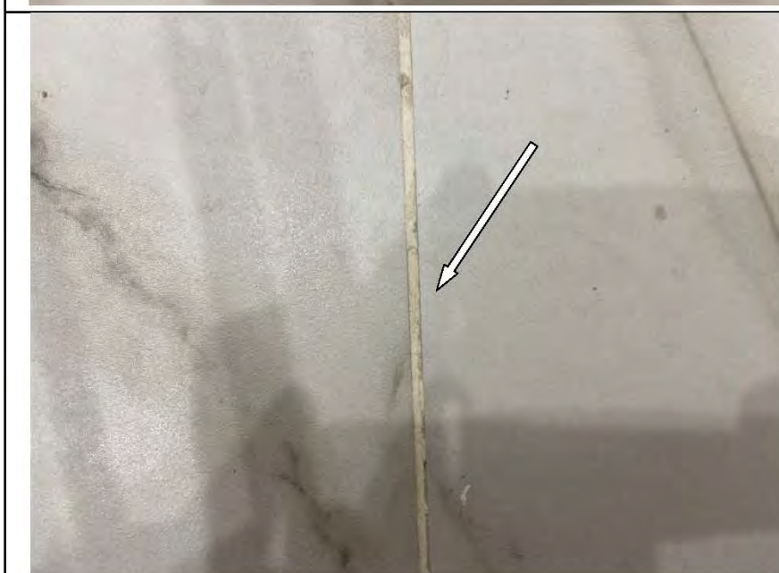
Фото №18. Неровные швы напольной керамической плитки в ванной комнате.
