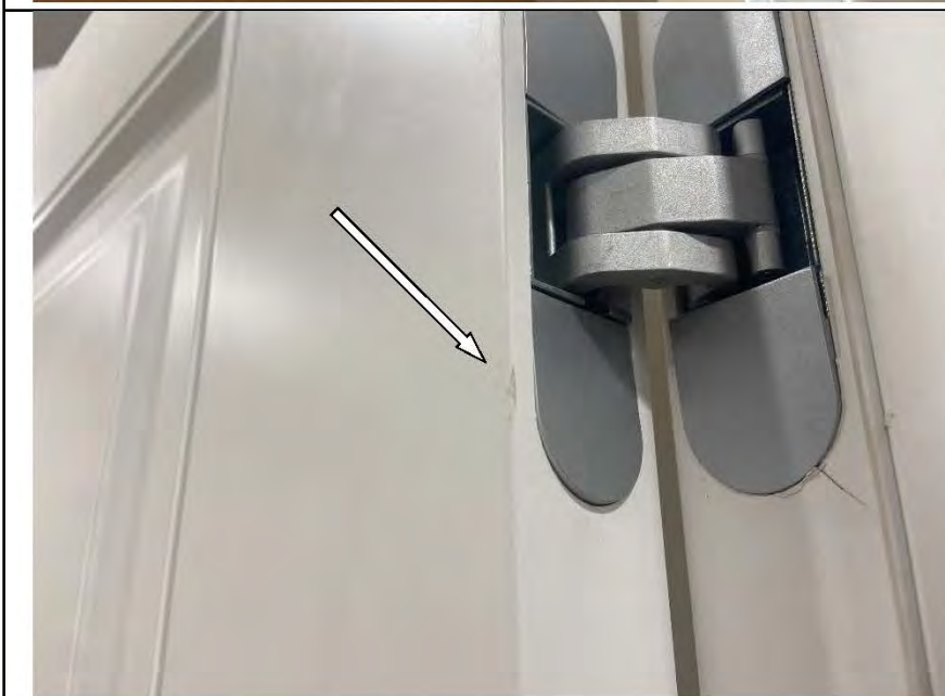
Фото №42. Дефект на полотне деревянного дверного блока в ванной комнате.
