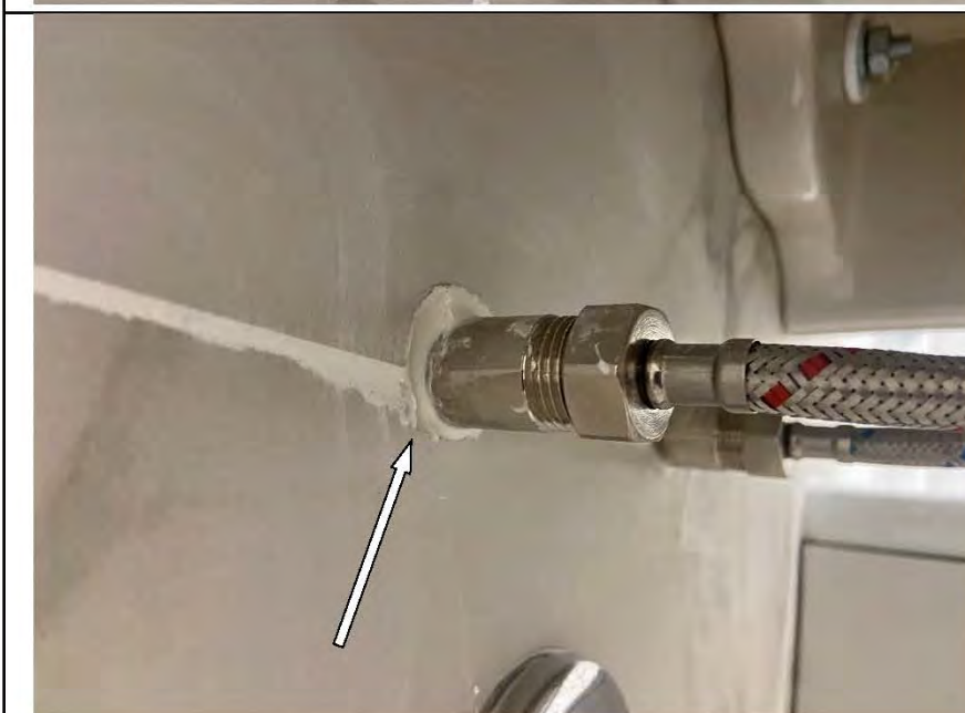
Фото №12. Сколы, отбитости настенной керамической плитки в ванной комнате.
