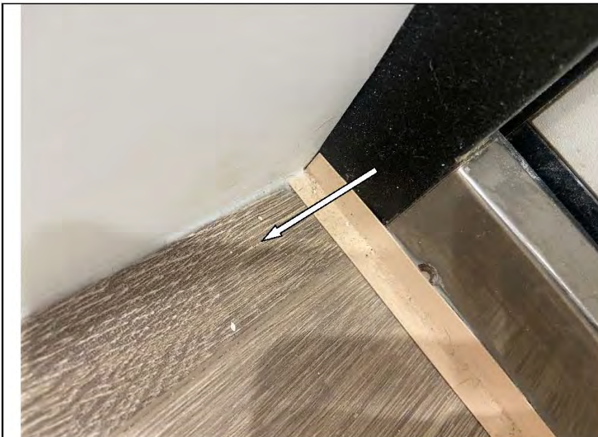
Фото №22. Дефект на напольном покрытии из ламината в коридоре.
