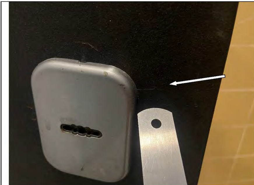
Фото №40. Дефект на полотне входного дверного блока в коридоре.
