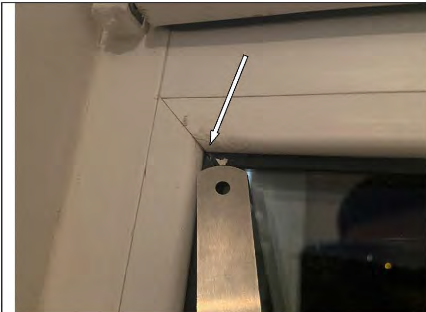
Фото №37. Дефект на уплотнительной ленте оконного блока ПВХ в кухне.
