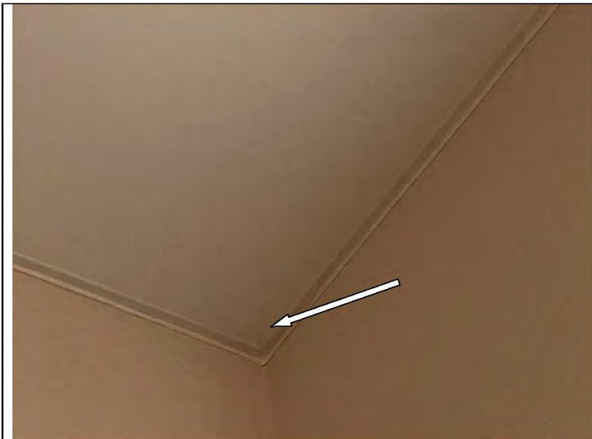
Фото №52. Дефект на поверхности натяжного потолка в спальне.
