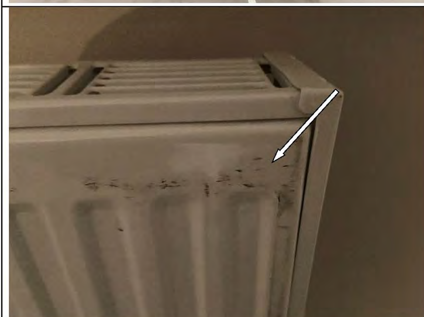
Фото №54. Дефект на поверхности металлического кожуха отопительного прибора в кухне.
