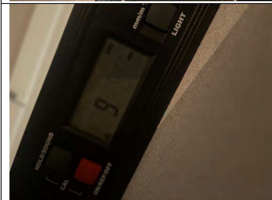
Фото №8. Отклонение поверхности стен от вертикали в спальне.
