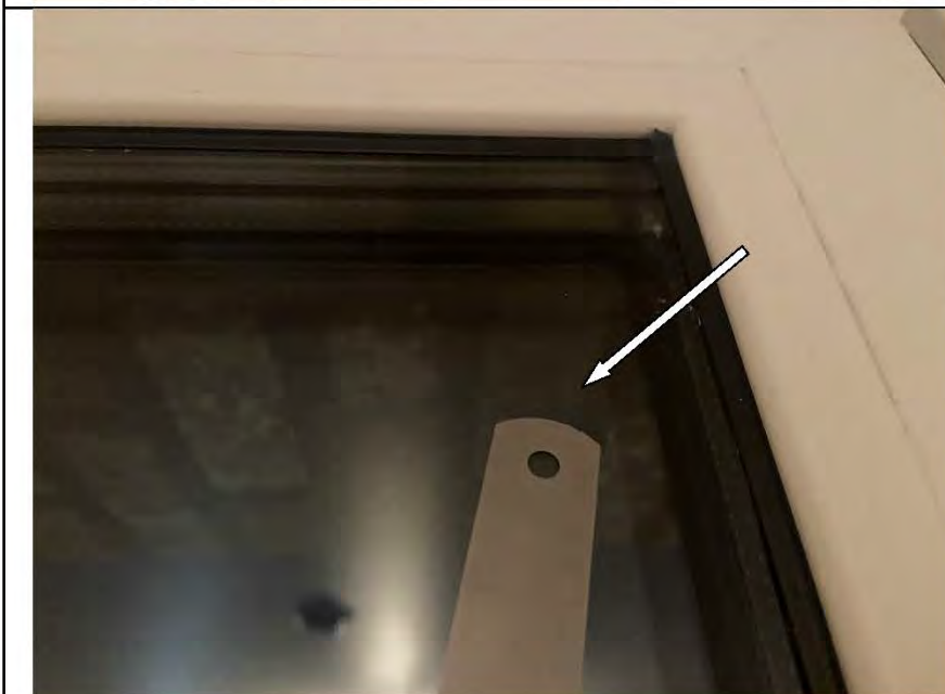
Фото №32. Царапина на стеклопакете оконного блока ПВХ в спальне.
