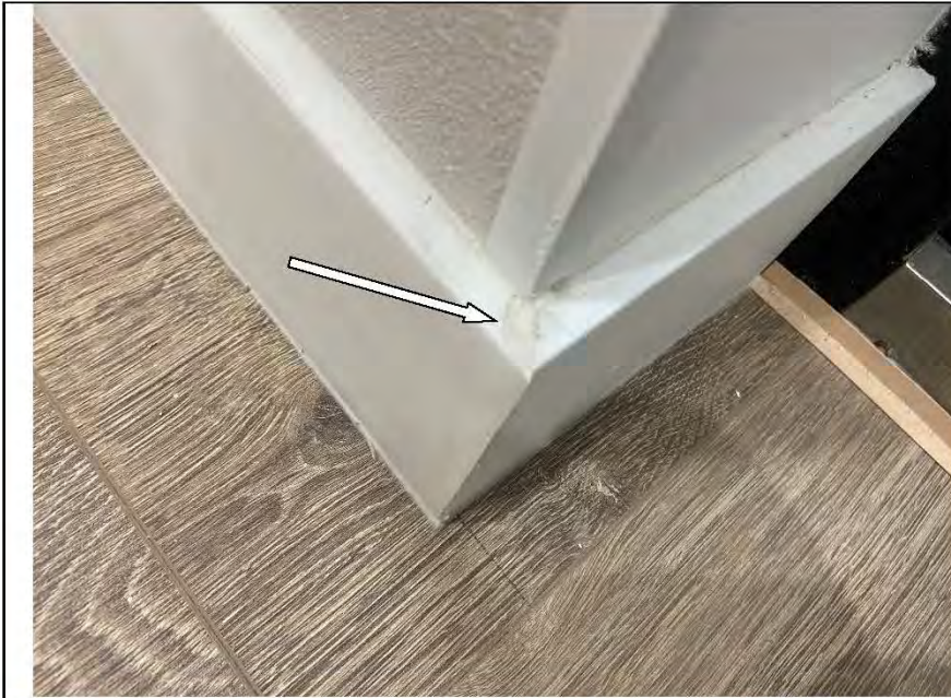
Фото №19. Дефект на напольном деревянном плинтусе в коридоре.
