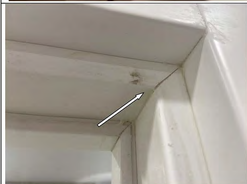
Фото №47. Дефект на коробке деревянного дверного блока в ванной комнате.
