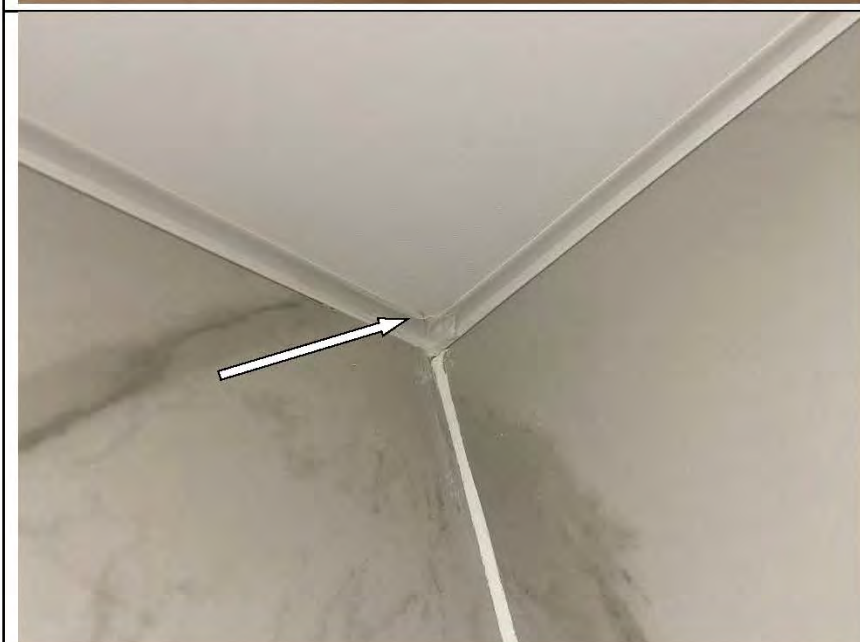
Фото №53. Дефект на поверхности натяжного потолка в ванной комнате.
