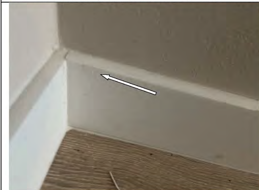
Фото №20. Дефект на напольном деревянном плинтусе в кухне.
