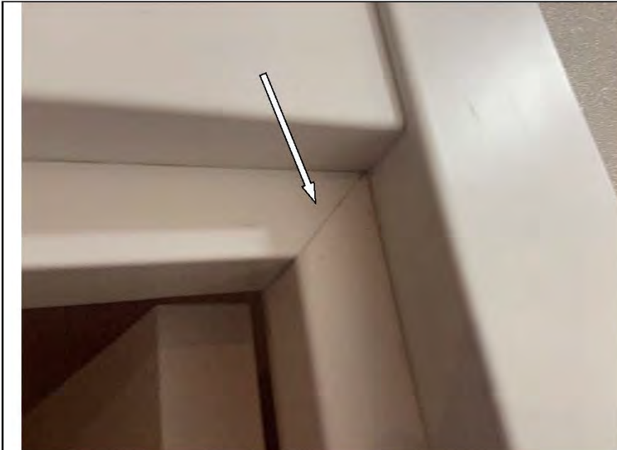
Фото №46. Дефект на коробке деревянного дверного блока в спальне.
