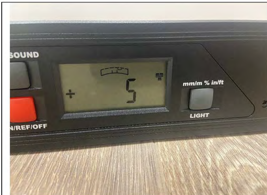
Фото №13. Отклонение поверхности напольного покрытия из ламината в коридоре.
