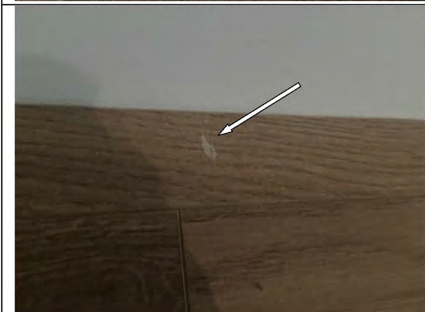
Фото №24. Дефект на напольном покрытии из ламината в спальне.
