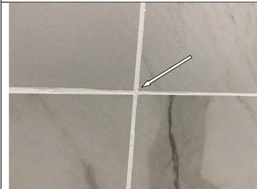
Фото №11. Неровные швы настенной керамической плитки в ванной комнате.
