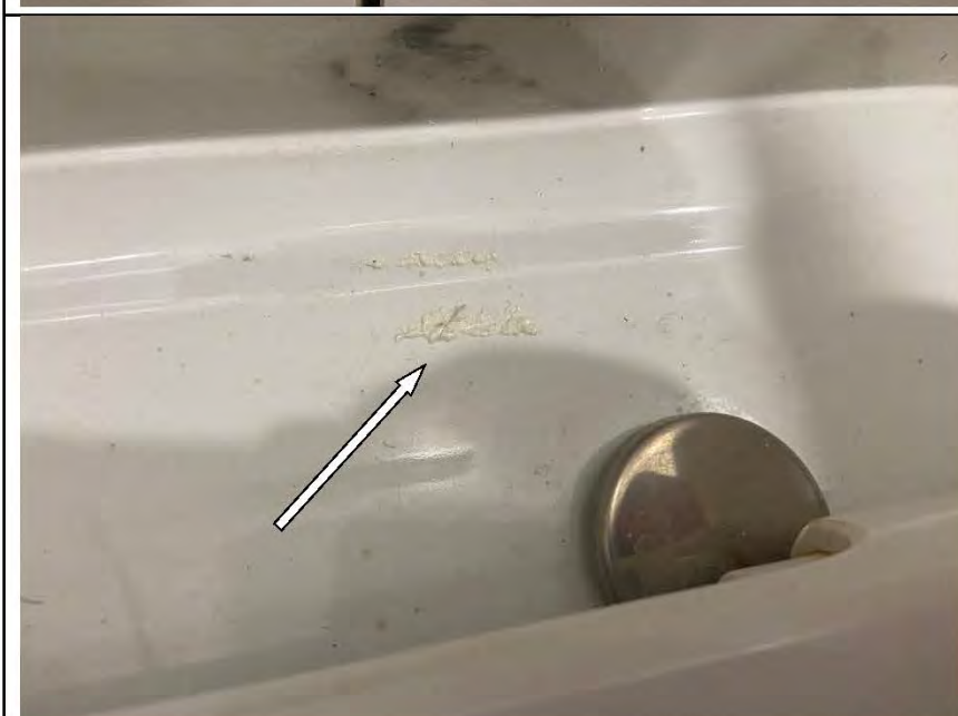
Фото №57. Загрязнения на унитазе в ванной комнате.
