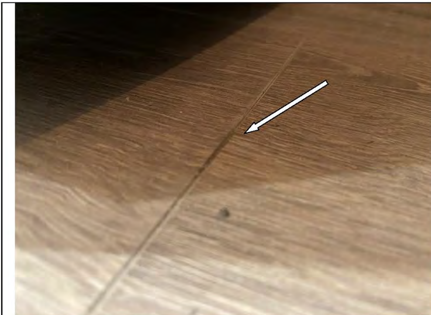
Фото №25. Поднятые кромки досок ламината в кухне.
