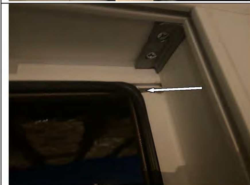
Фото №38. Дефект на уплотнительной ленте оконного блока ПВХ в спальне.
