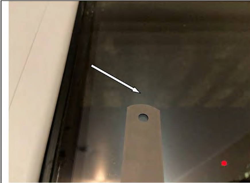
Фото №31. Царапина на стеклопакете оконного блока ПВХ в кухне.
