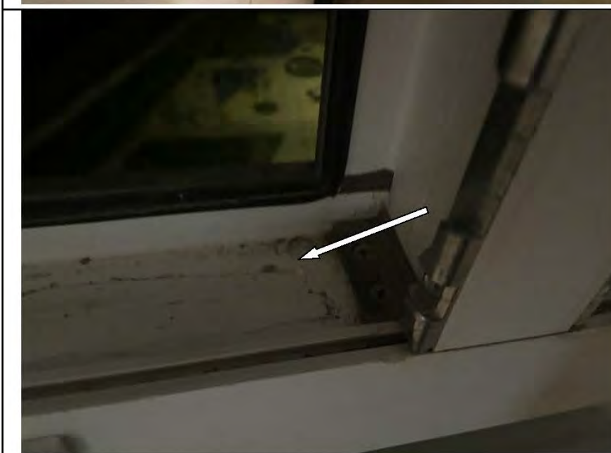
Фото №30. Дефект на профиле оконного блока ПВХ в спальне.
