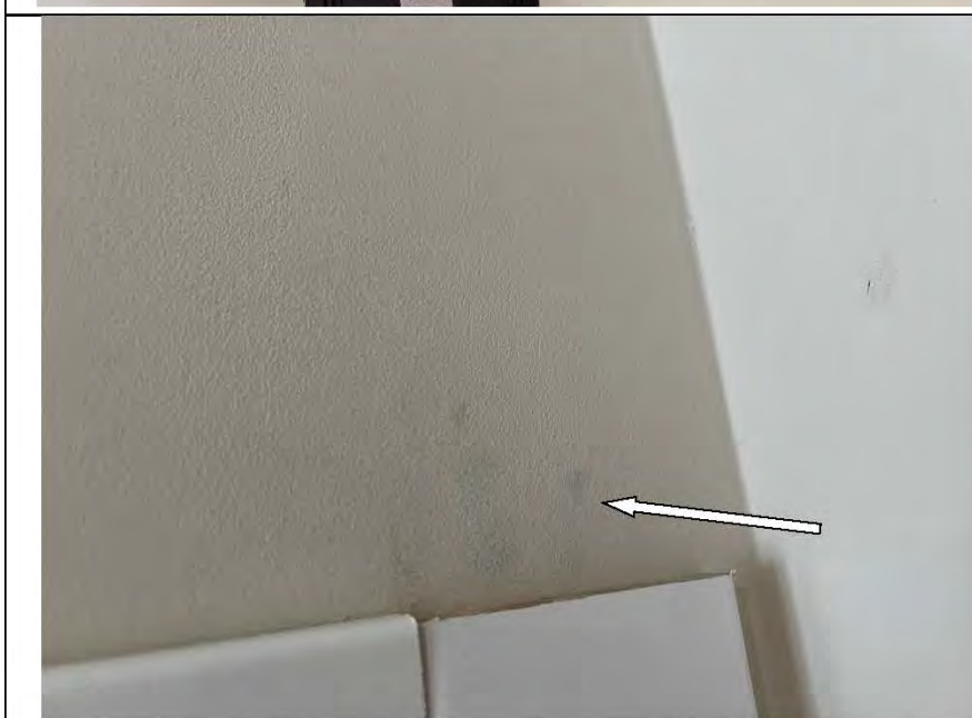
Фото №9. Загрязнение поверхности окрашенной стены в кухне.
