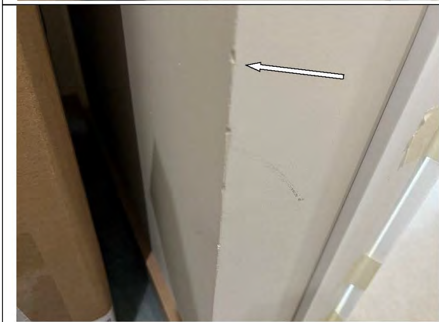
Фото №12. Скол краски на поверхности стен в прихожей.
