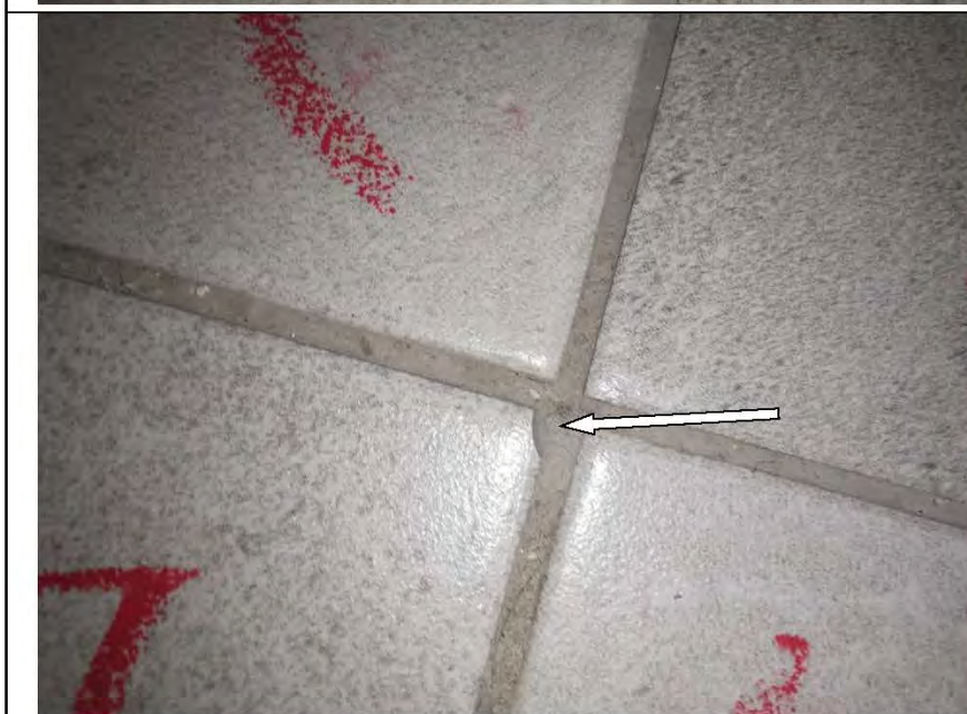
Фото №39. Отбитости на напольной керамической плитке в ванной комнате.
