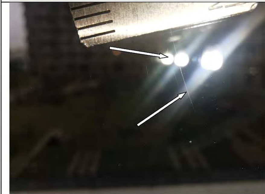
Фото №53. Царапины на стеклопакете оконного блока в спальне.
