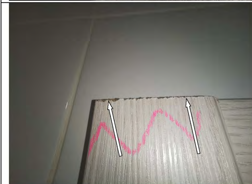
Фото №62. Повреждение ламинации наличников деревянного дверного блока в спальне.
