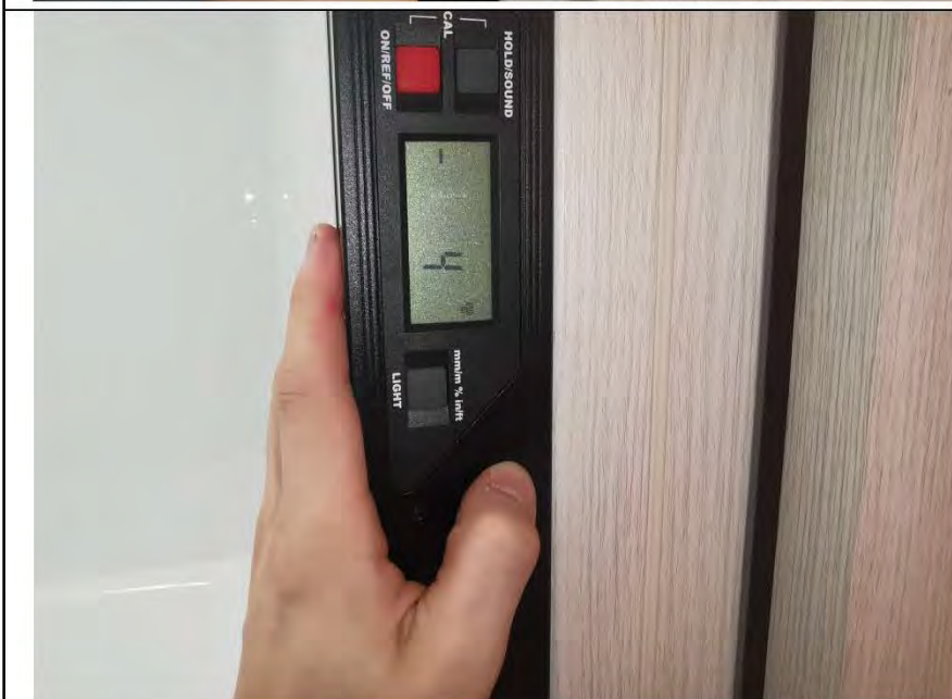
Фото №59. Отклонение коробки деревянного дверного блока от уровня вертикальности в ванной комнате.
