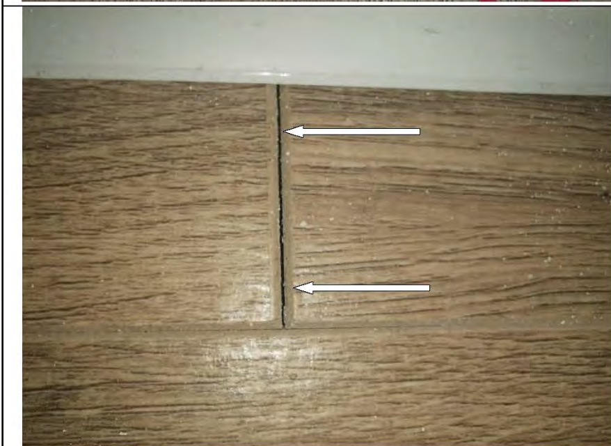
Фото №26. Зазор между соседними досками ламината в спальне.
