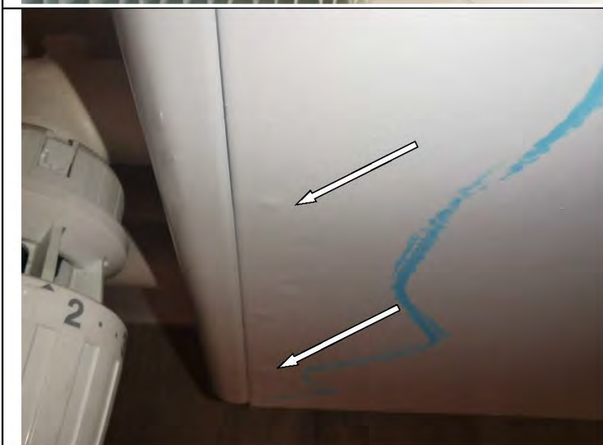
Фото №72. Повреждение кожуха радиатора в кухне.
