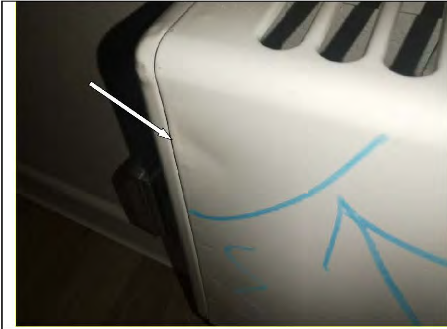
Фото №73. Повреждение кожуха радиатора в спальне.
