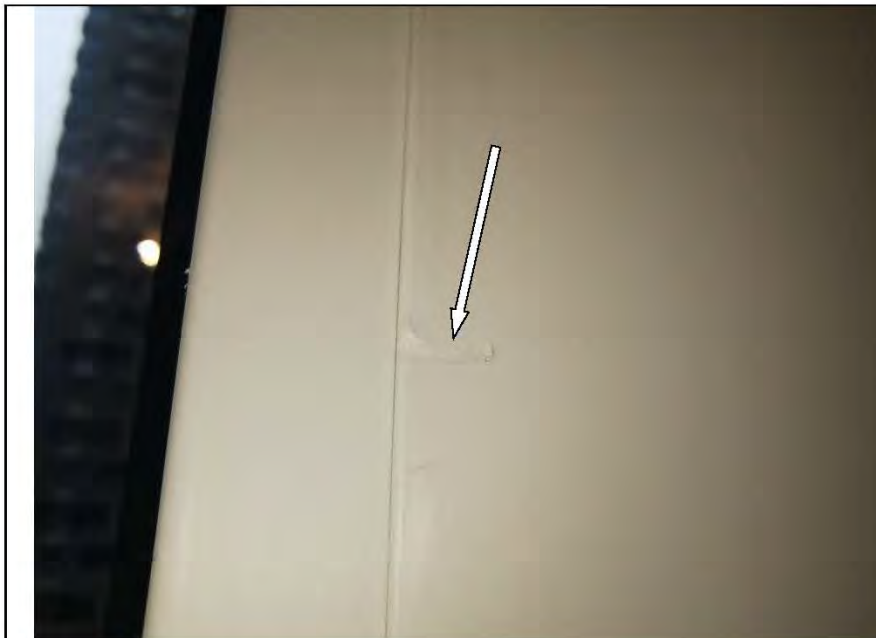
Фото №43. Царапины на профиле ПВХ оконного блока в кухне.
