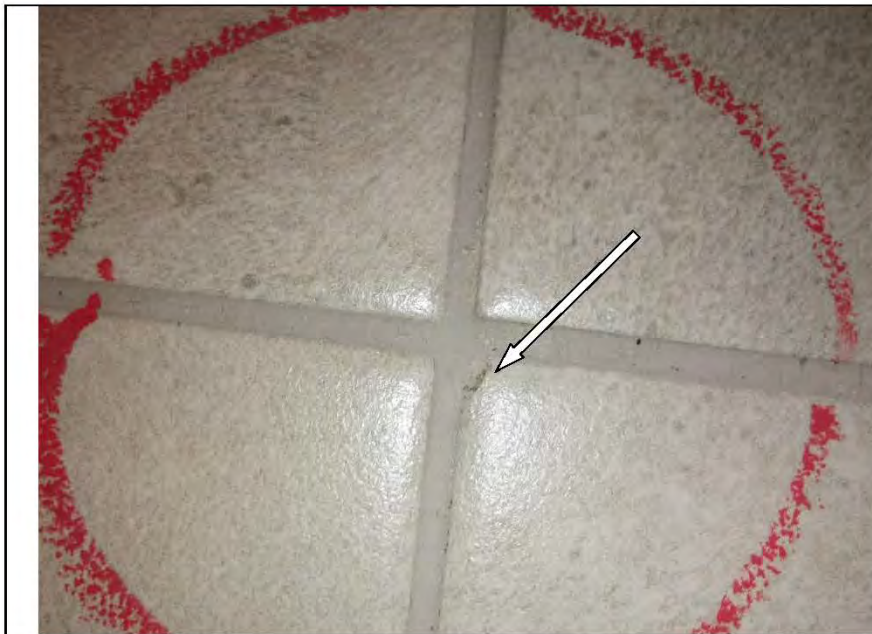
Фото №37. Отбитости на напольной керамической плитке в кухне.
