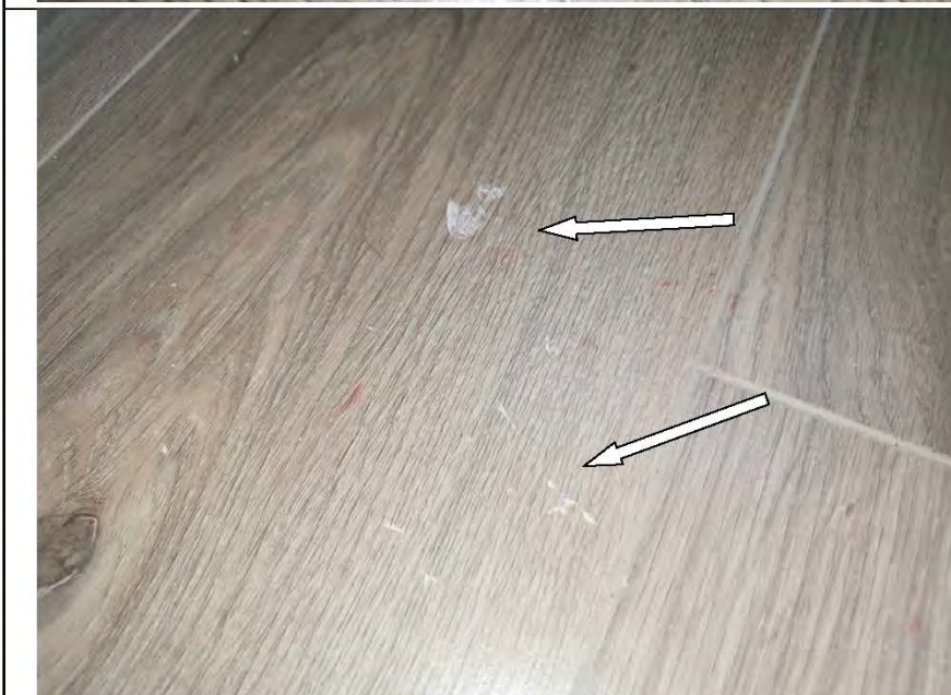
Фото №29. Загрязнение ламината в спальне.
