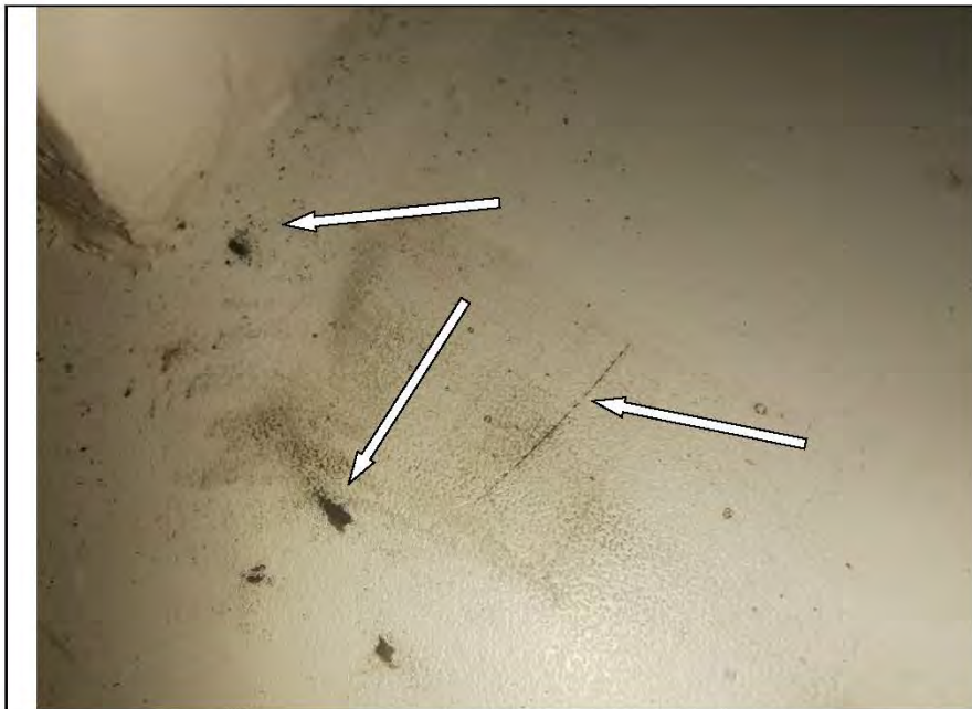
Фото №55. Царапины на лицевой поверхности подоконной доски в кухне.
