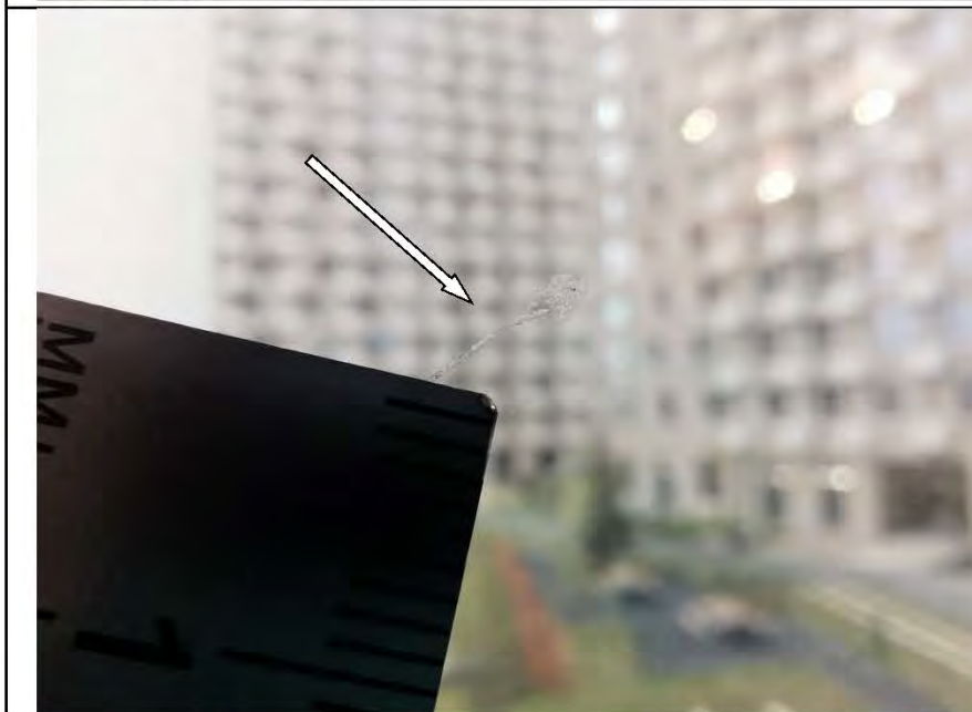
Фото №50. Окалины на стеклопакете оконного блока в кухне.
