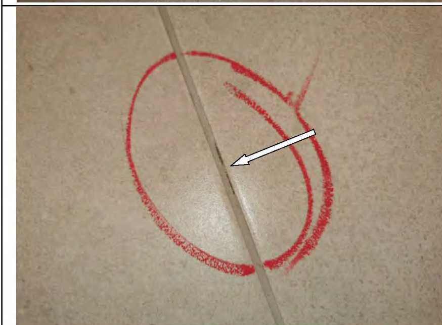
Фото №35. Затирка напольной керамической плитки в кухне выполнена с нарушениями.
