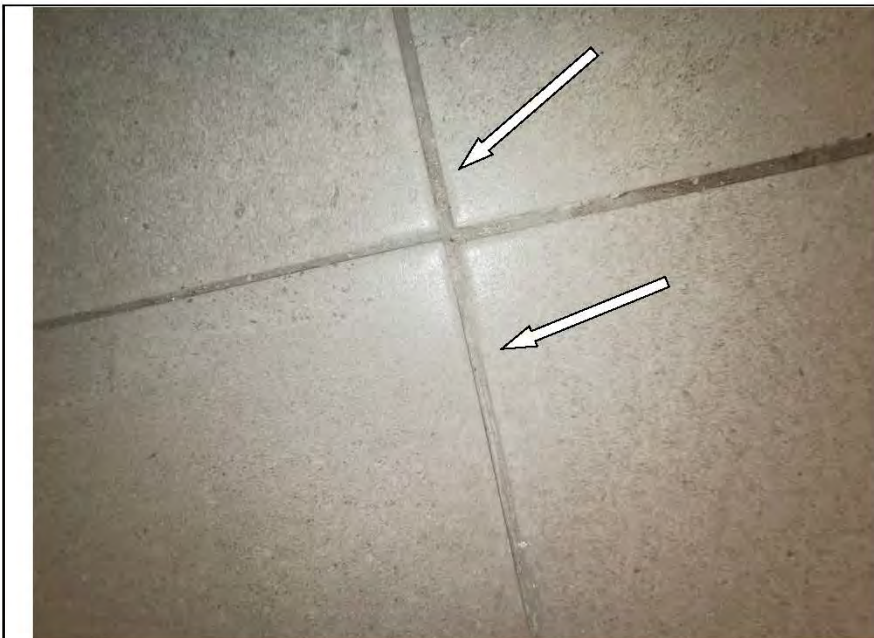
Фото №34. Затирка напольной керамической плитки в прихожей выполнена с нарушениями.
