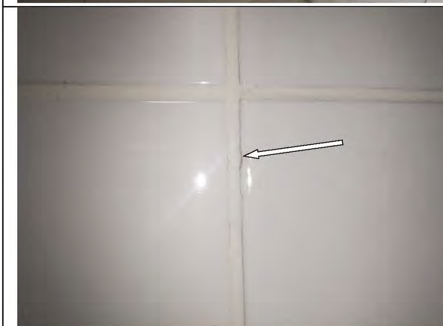
Фото №20. Отбитости на настенной керамической плитке в ванной комнате.
