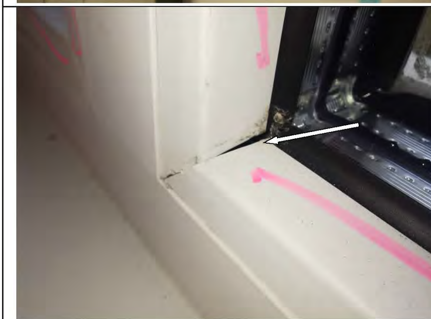
Фото №45. Зазор в месте стыка профилей ПВХ оконного блока в кухне.
