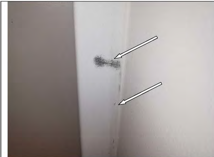
Фото №67. Загрязнение короба входного дверного блока.
