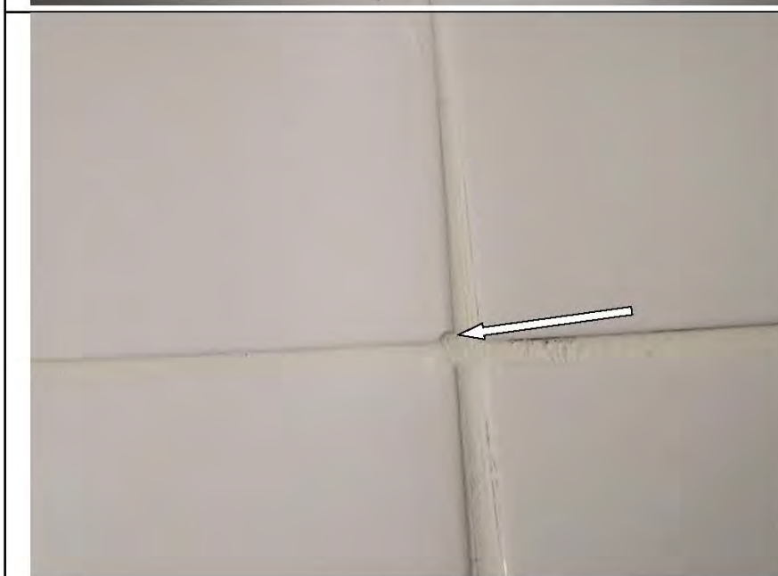
Фото №21. Отбитости на настенной керамической плитке в ванной комнате.
