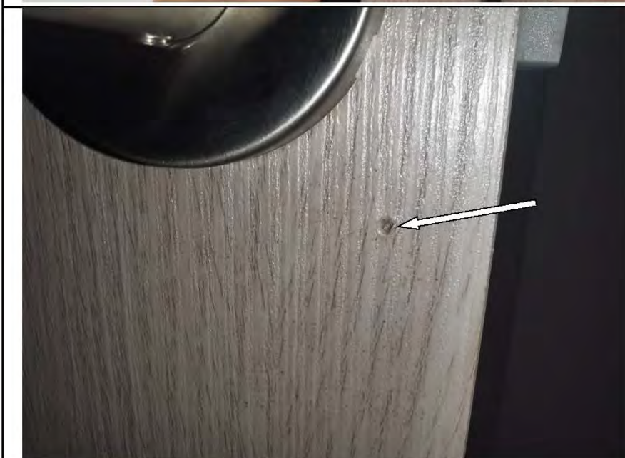
Фото №60. Повреждение ламинации полотна деревянного дверного блока в спальне.
