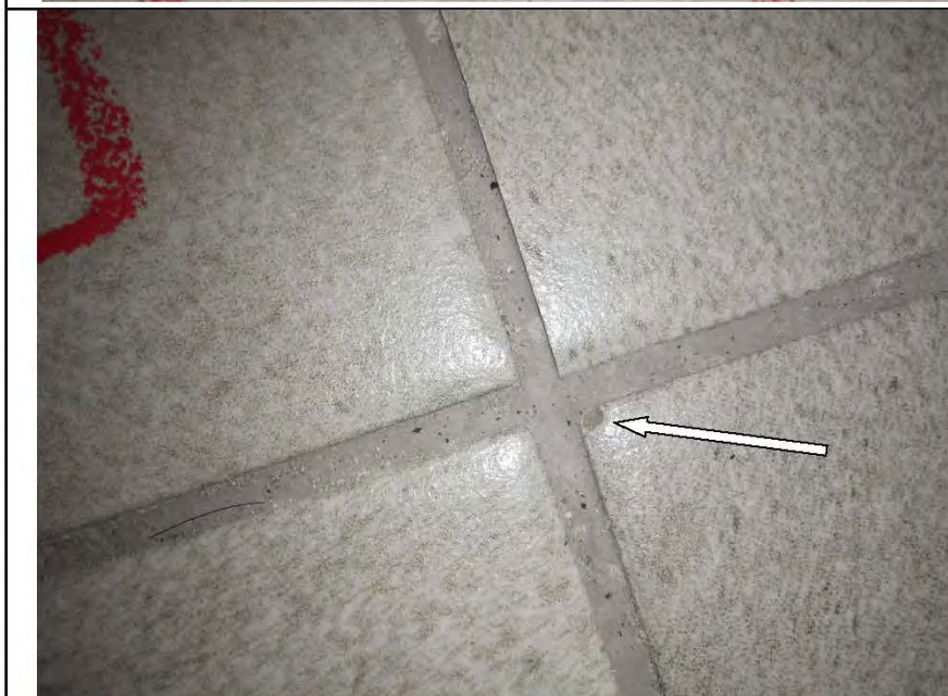
Фото №38. Отбитости на напольной керамической плитке в коридоре.
