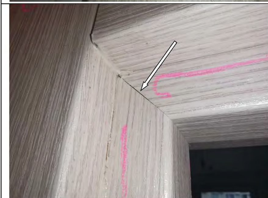
Фото №63. Ненадежное соединение элементов деревянного дверного блока в спальне.
