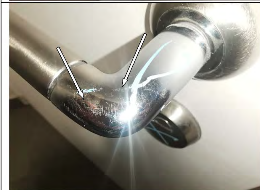
Фото №68. Царапины на фурнитуре входного дверного блока.
