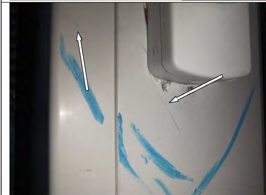
Фото №47. Загрязнения и царапины на профиле ПВХ оконного блока в спальне.
