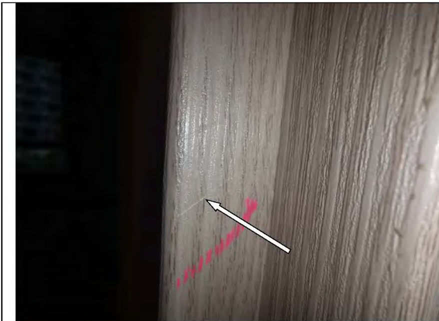
Фото №61. Царапины на коробе деревянного дверного блока в ванной комнате.
