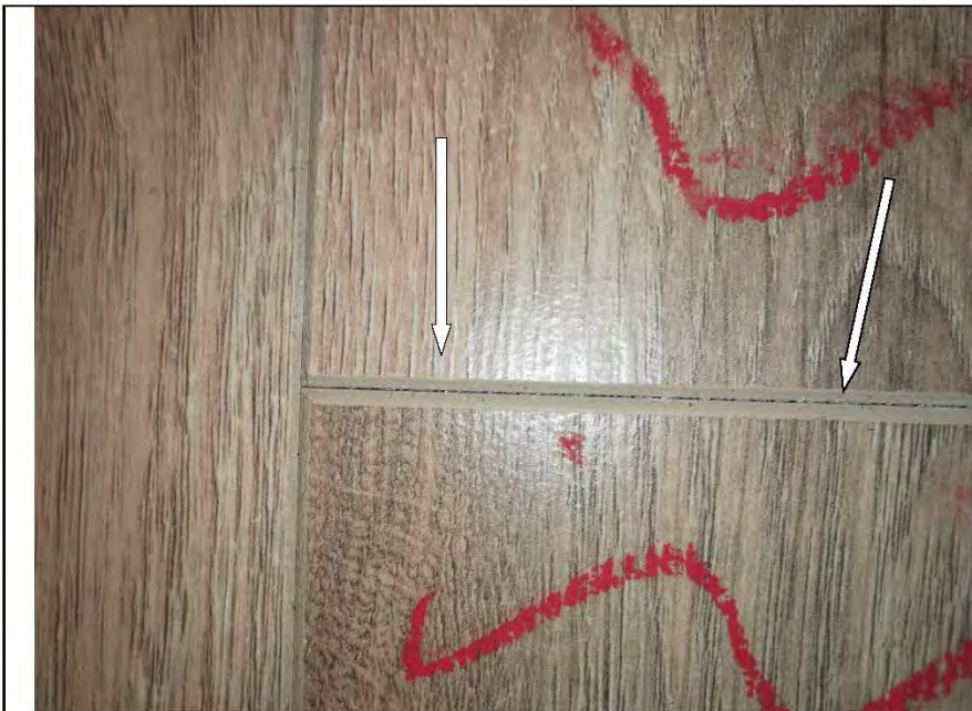
Фото №25. Зазор между соседними досками ламината в кухне.
