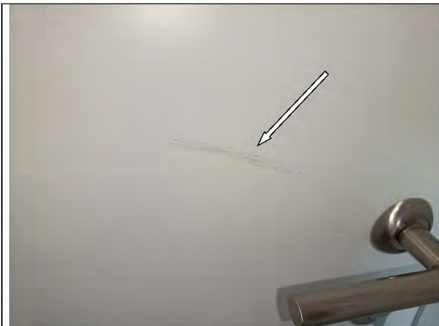
Фото №55. Загрязнения и потертости на полотне входного дверного блока.
