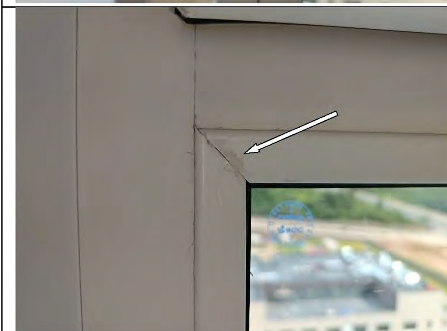
Фото №45. Загрязнения на профиле ПВХ оконного блока в спальне.
