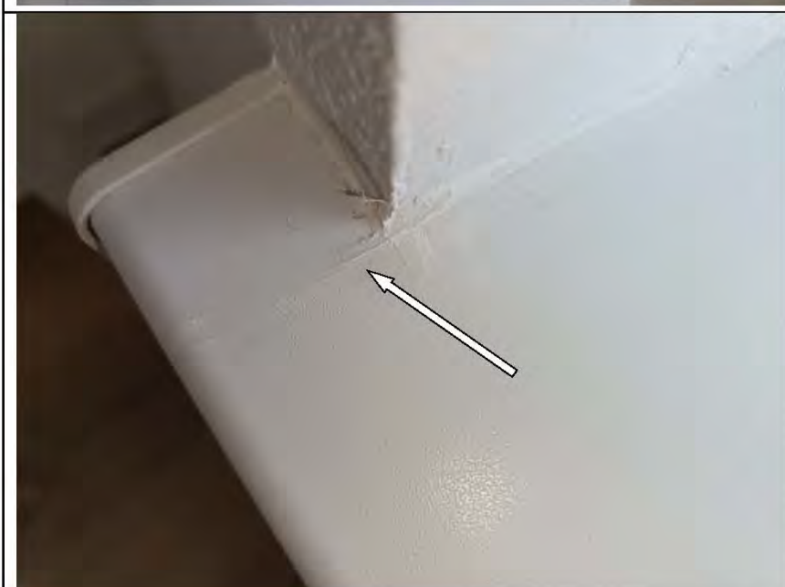
Фото №51. Царапины на лицевой поверхности подоконной доски в кухне.
