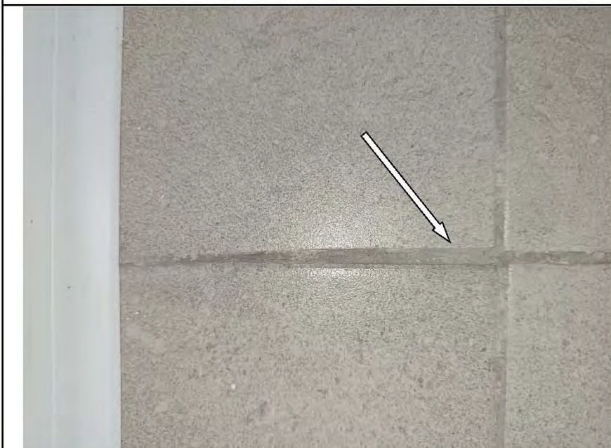
Фото №26. Затирка напольной плитки выполнена с нарушениями в кухне.
