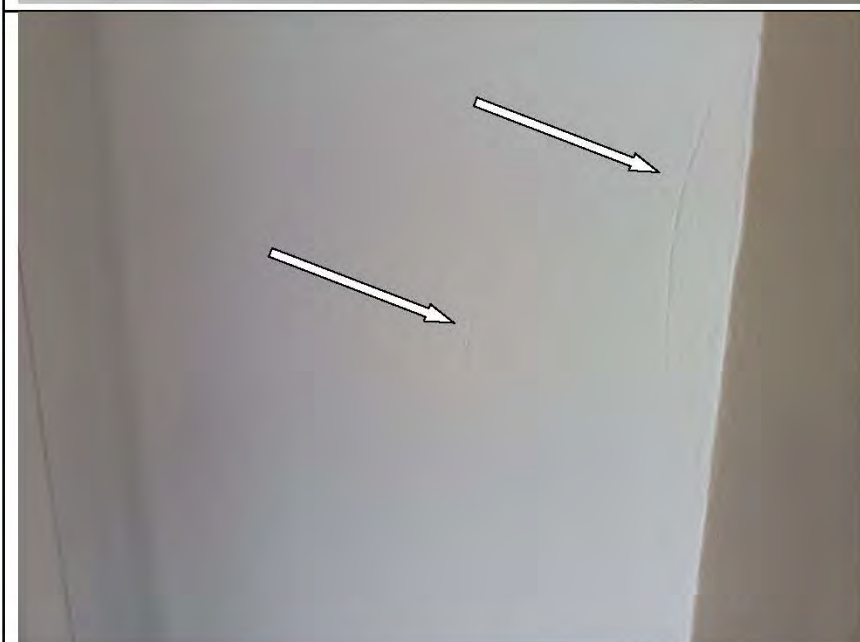
Фото №50. Окрашенные откосы оконного блока ПВХ выполнены с дефектами в спальне.
