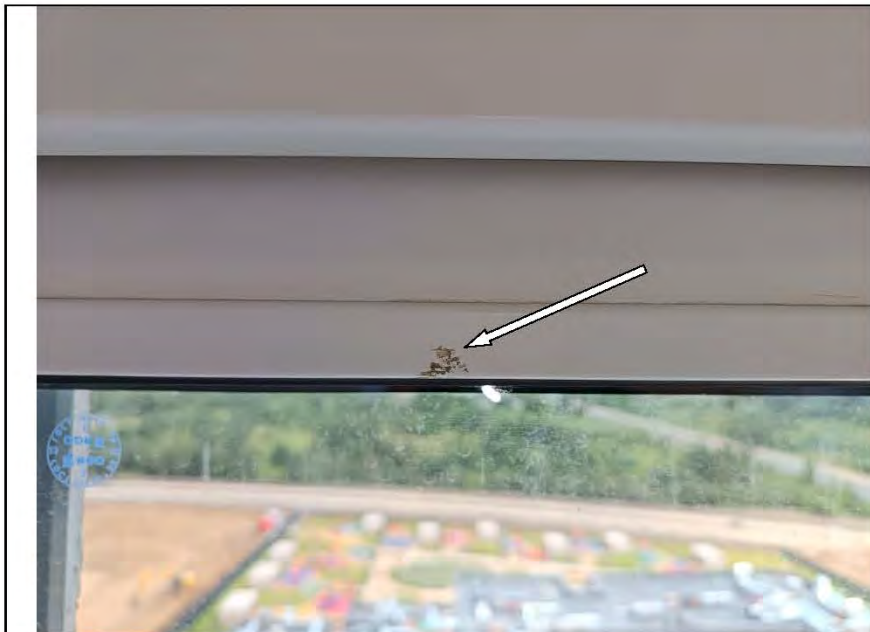
Фото №46. Загрязнения на профиле ПВХ оконного блока в спальне.
