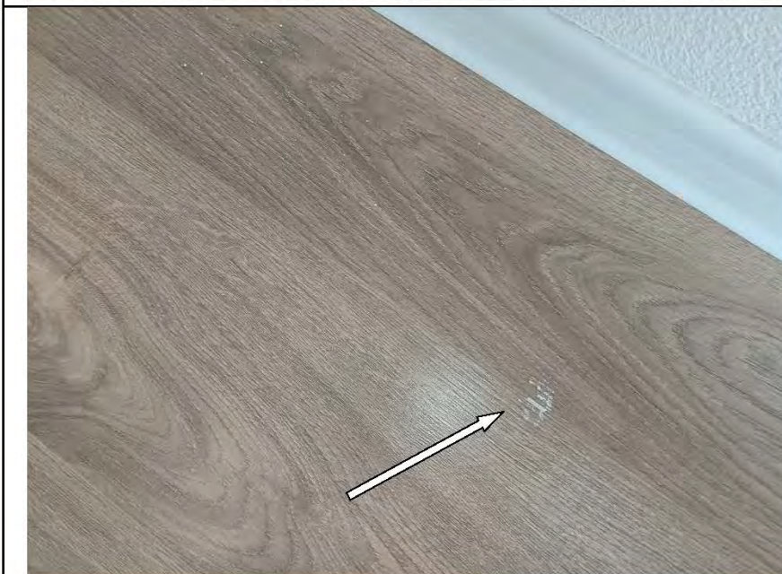
Фото №32. Загрязнение ламината в кухне.
