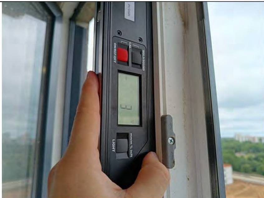
Фото №74. Отклонение ПВХ оконного блока в кухне по уровню вертикальности.
