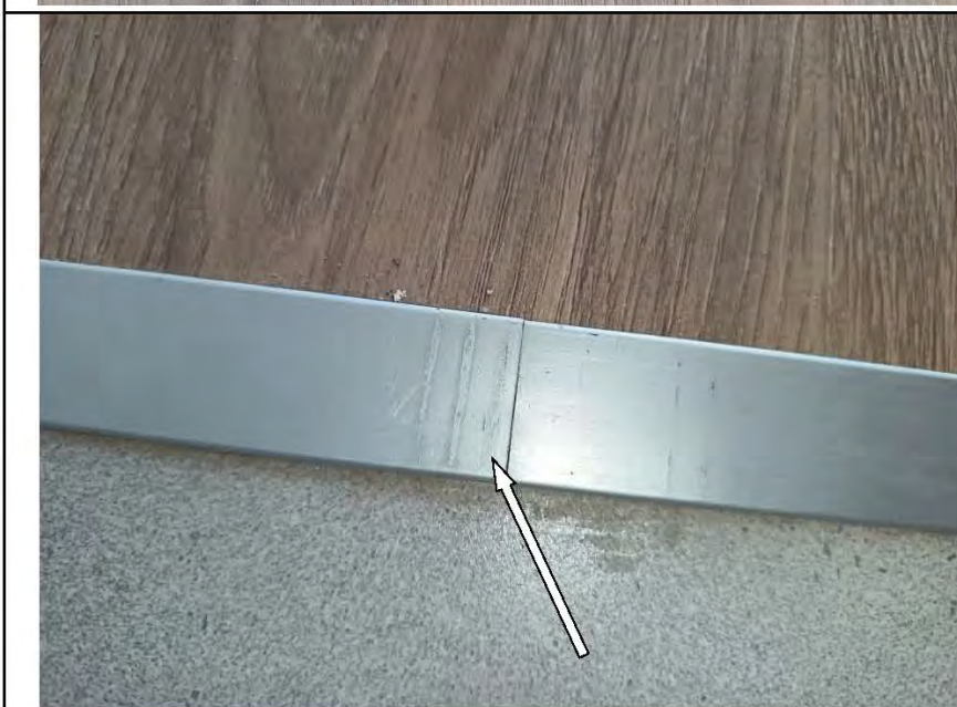
Фото №36. Царапины на металлическом пороге в кухне.
