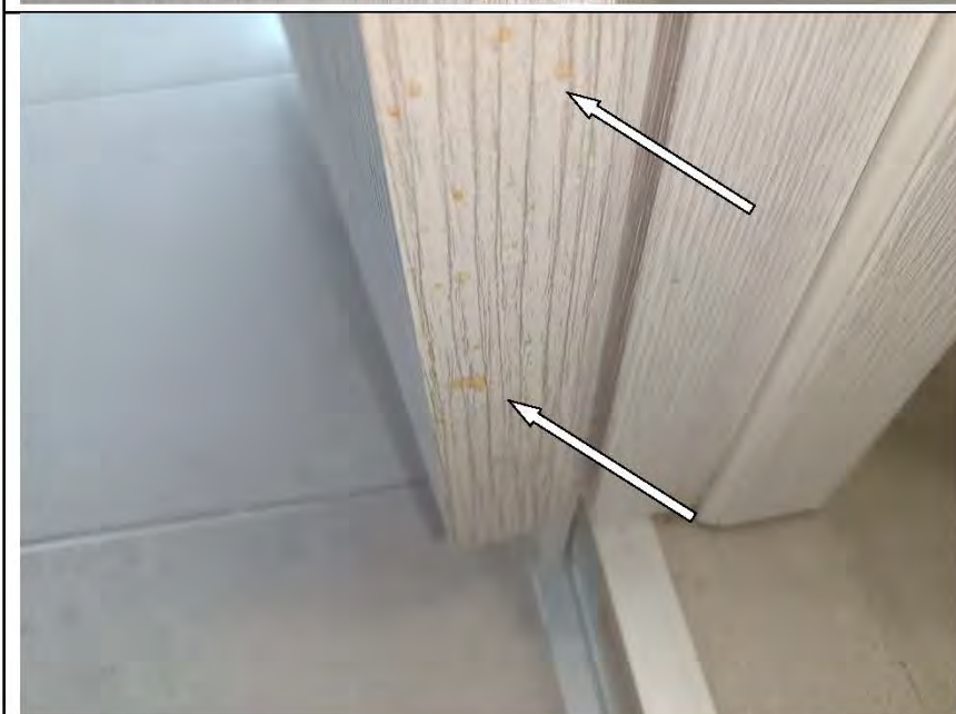
Фото №62. Загрязнение на наличниках деревянного дверного блока в санузле.
