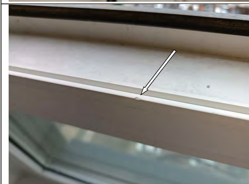
Фото №42. Скол на профиле ПВХ оконного блока в спальне.
