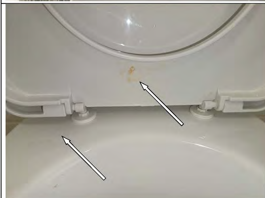
Фото №77. Загрязнение на унитазе в санузле.
