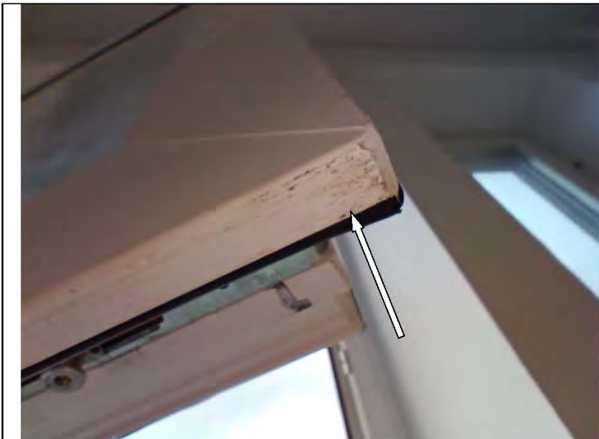
Фото №43. Потертости и загрязнения на профиле ПВХ оконного блока в спальне.
