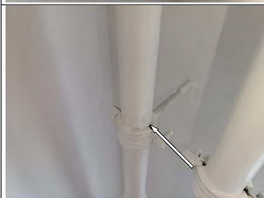
Фото №72. Окрашивание труб отопления выполнено с дефектами в кухне.
