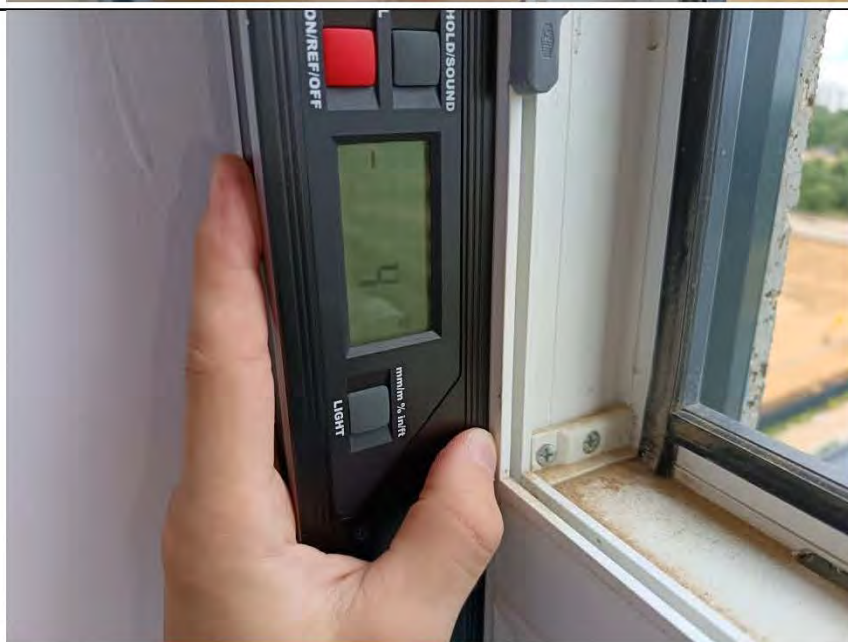
Фото №75. Отклонение ПВХ оконного блока в спальне по уровню вертикальности.
