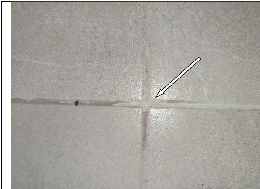
Фото №28. Затирка напольной плитки выполнена с нарушениями в коридоре.
