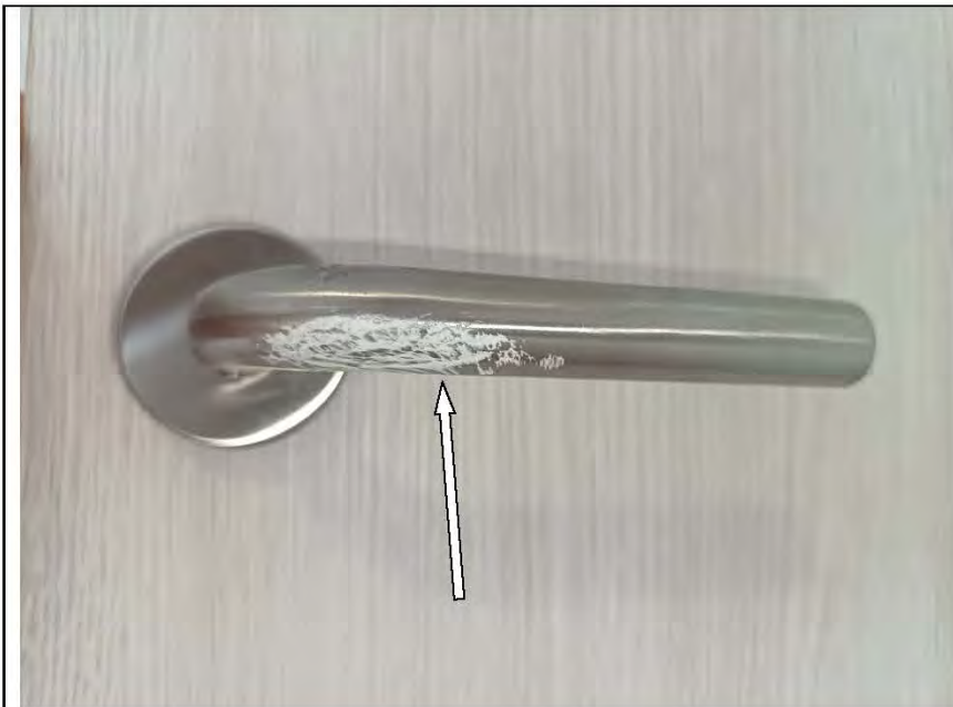
Фото №67. Загрязнения на фурнитуре деревянного дверного блока в спальне.
