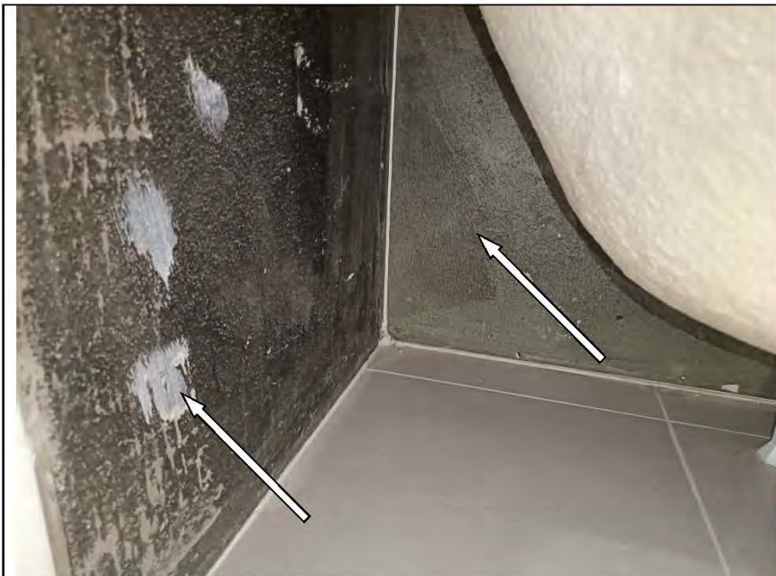
Фото №76. Частично отсутствует настенная керамическая плитка за ванной.
