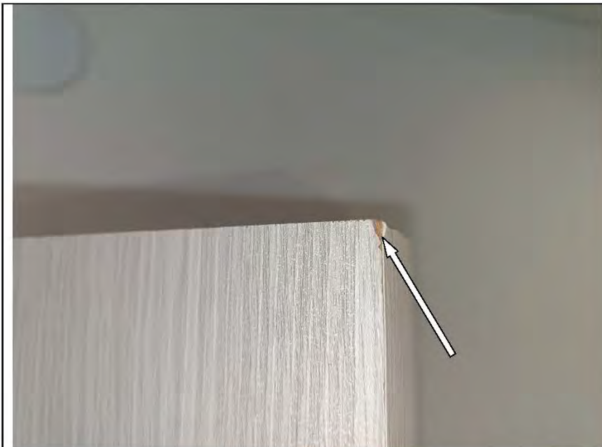
Фото №61. Повреждение ламинации полотна деревянного дверного блока в санузле.
