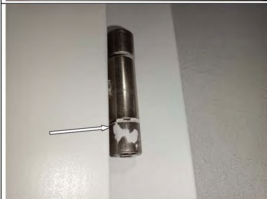
Фото №59. Загрязнения на фурнитуре входного дверного блока.
