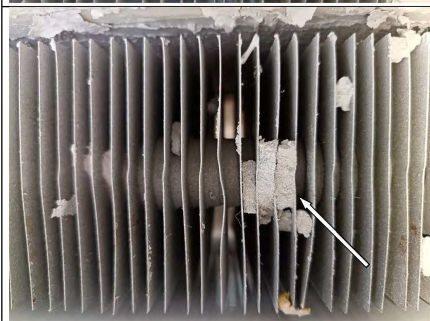
Фото №71. Загрязнение радиатора в спальне.
