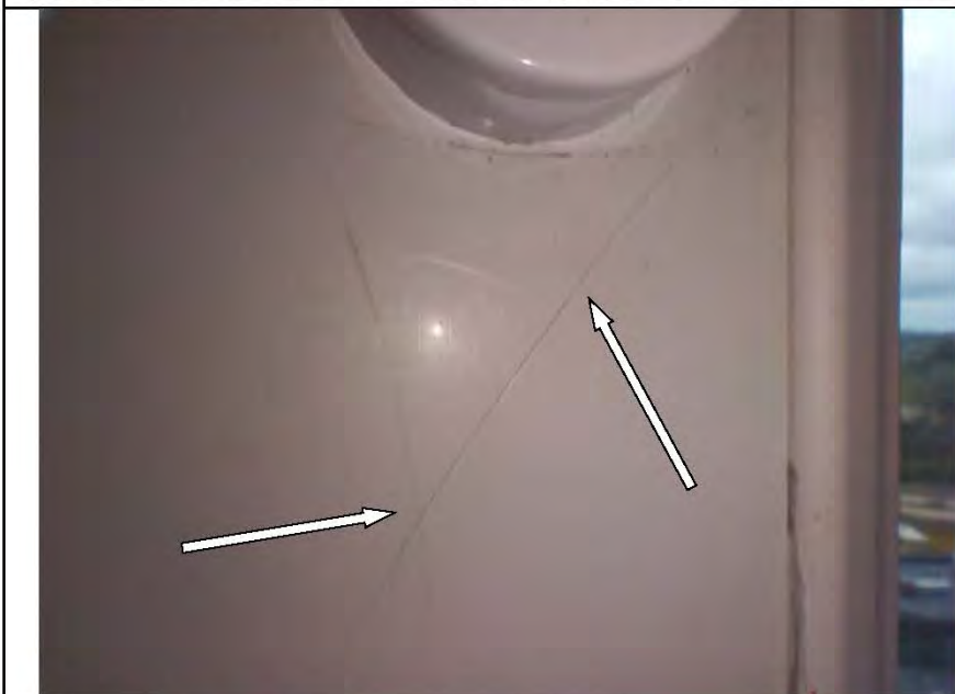
Фото №38. Царапины на профиле ПВХ оконного блока в кухне.
