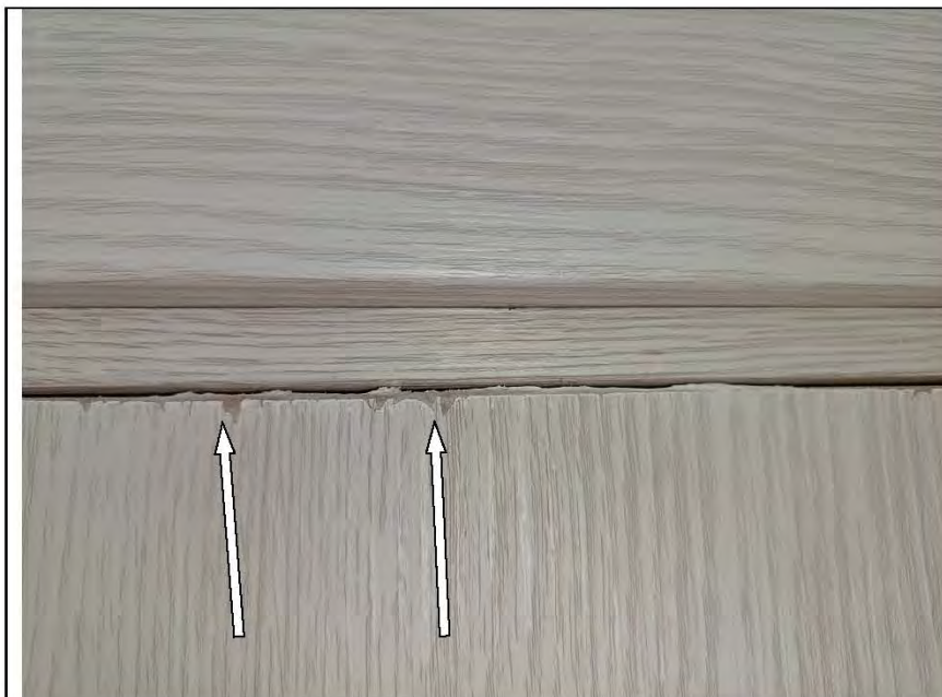
Фото №64. Повреждение ламинации полотна деревянного дверного блока в спальне.
