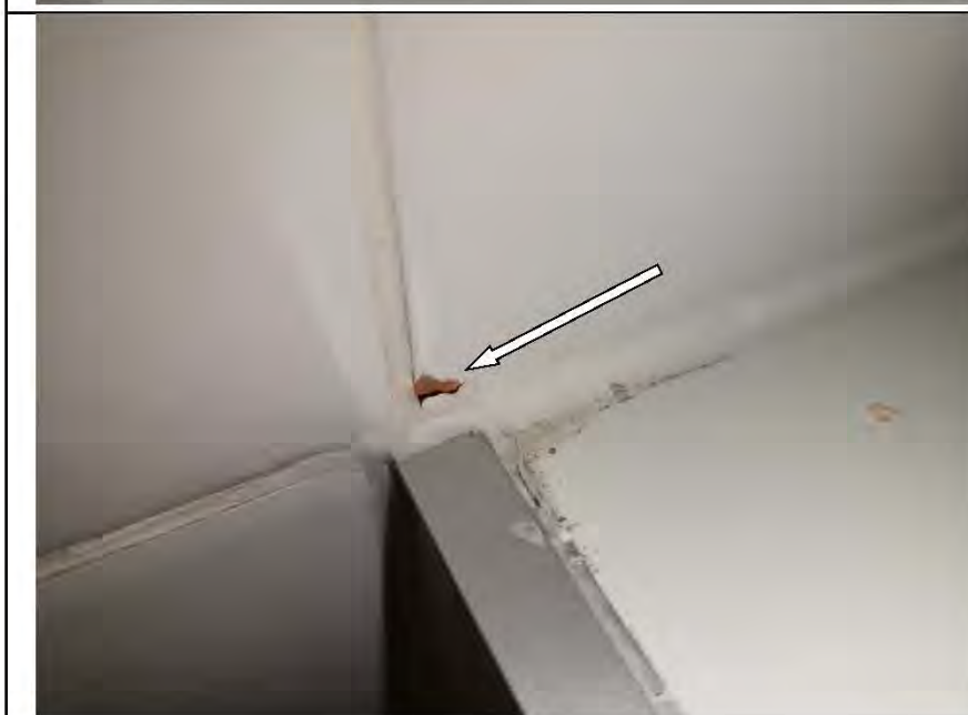
Фото №21. Отбитости на настенной керамической плитке в санузле.
