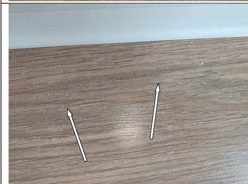
Фото №33. Загрязнение ламината в кухне.
