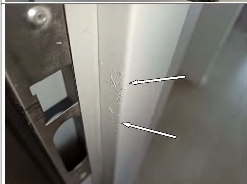
Фото №57. Загрязнения на полотне входного дверного блока.
