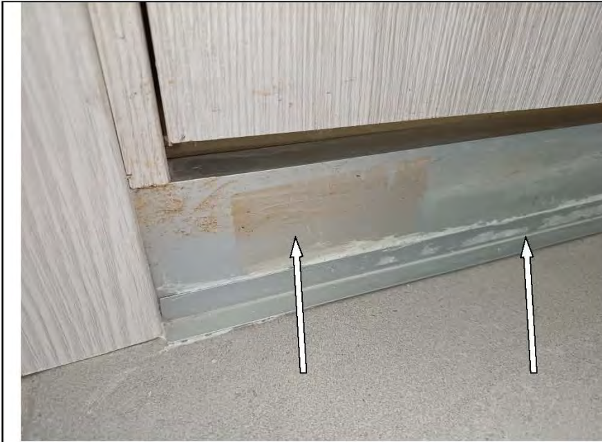
Фото №37. Загрязнения и потертости на металлическом пороге в санузле.
