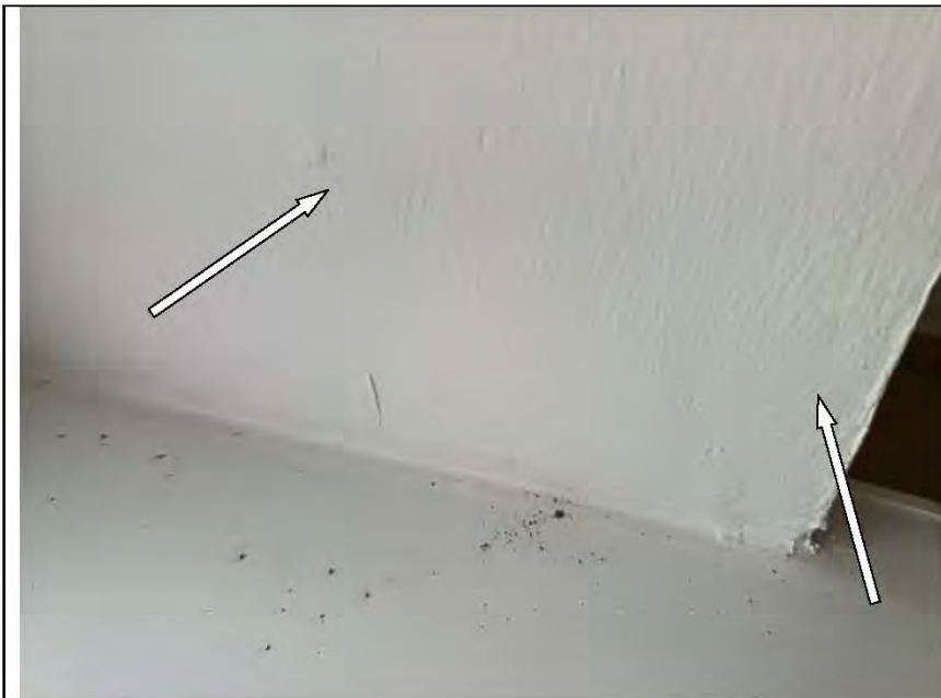
Фото №49. Окрашенные откосы оконного блока ПВХ выполнены с дефектами в кухне.
