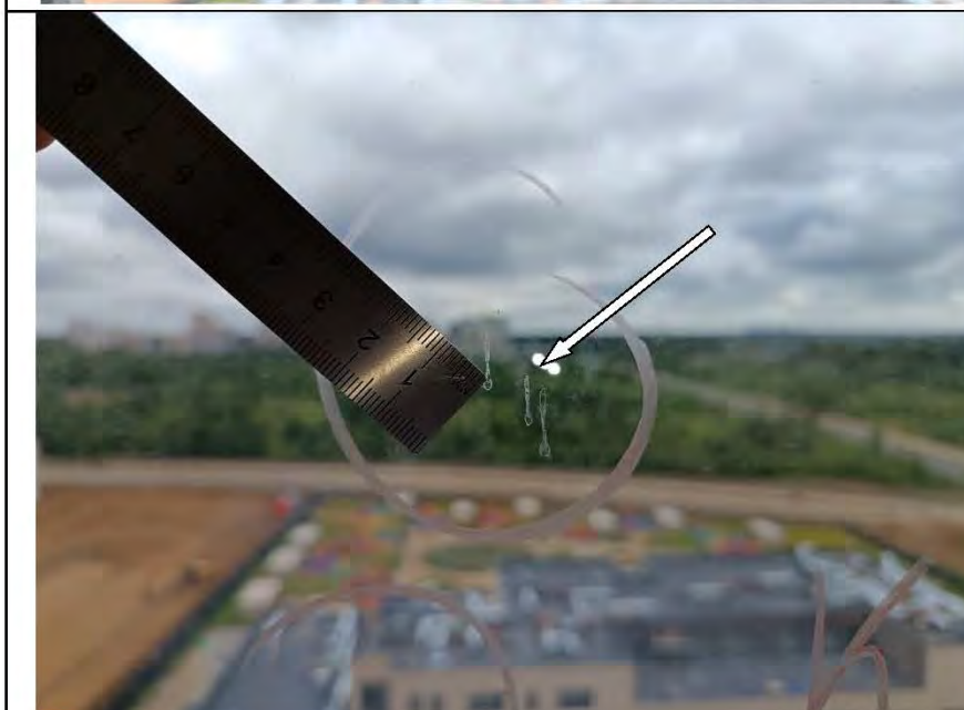
Фото №47. Загрязнения на стеклопакете оконного блока ПВХ в спальне.
