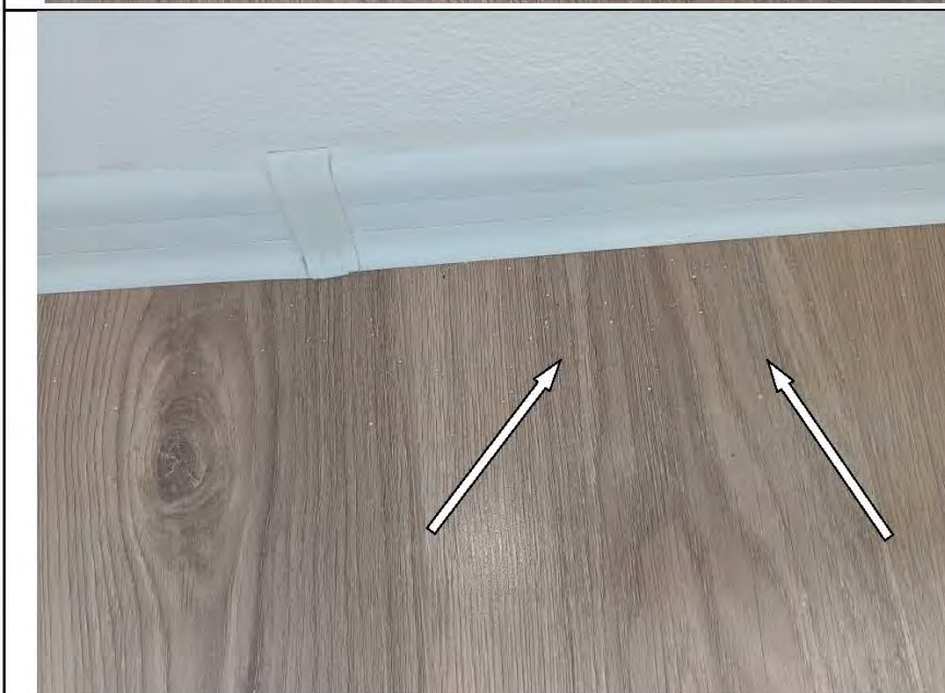
Фото №35. Загрязнение ламината в спальне.
