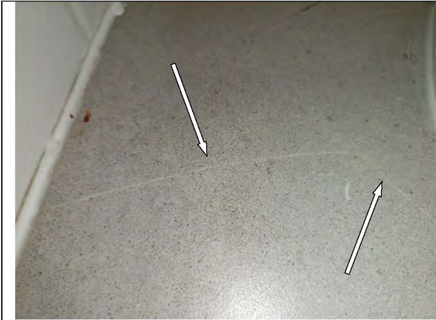
Фото №31. Царапины на керамической плитке в санузле.
