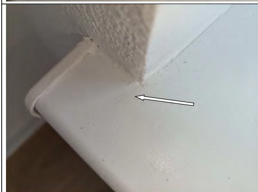
Фото №53. Царапины на лицевой поверхности подоконной доски в спальне.
