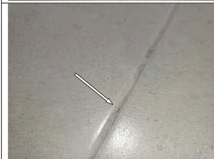
Фото №30. Затирка напольной плитки выполнена с нарушениями в кухне.
