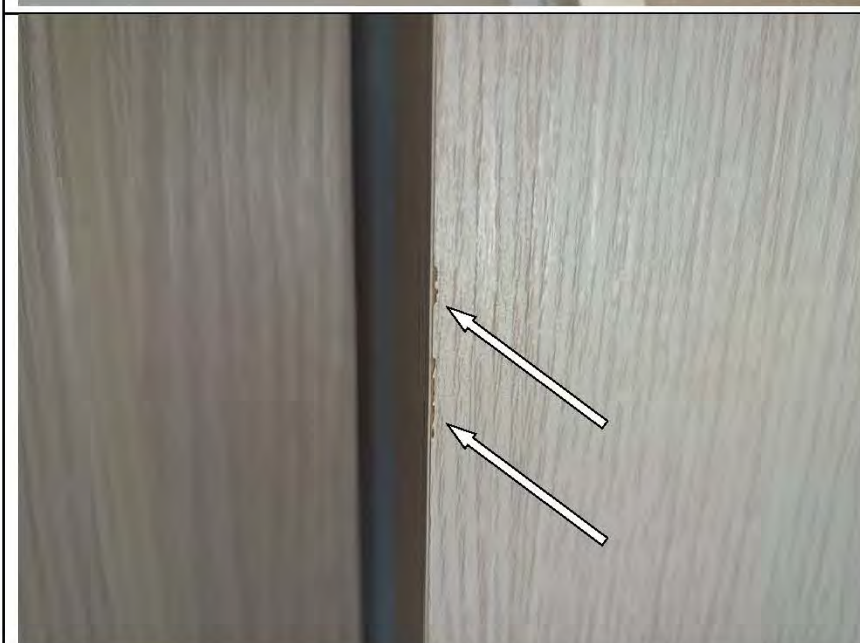
Фото №63. Повреждение ламинации полотна деревянного дверного блока в спальне.
