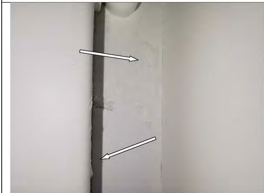
Фото №27. Загрязнения на профиле ПВХ оконного блока в комнате.
