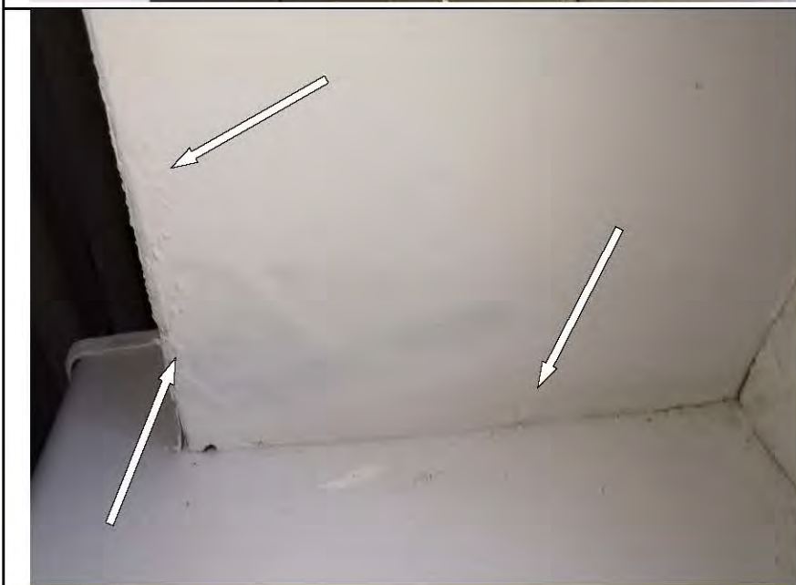
Фото №42. Поверхность откосов оконного блока не отшлифована в комнате.
