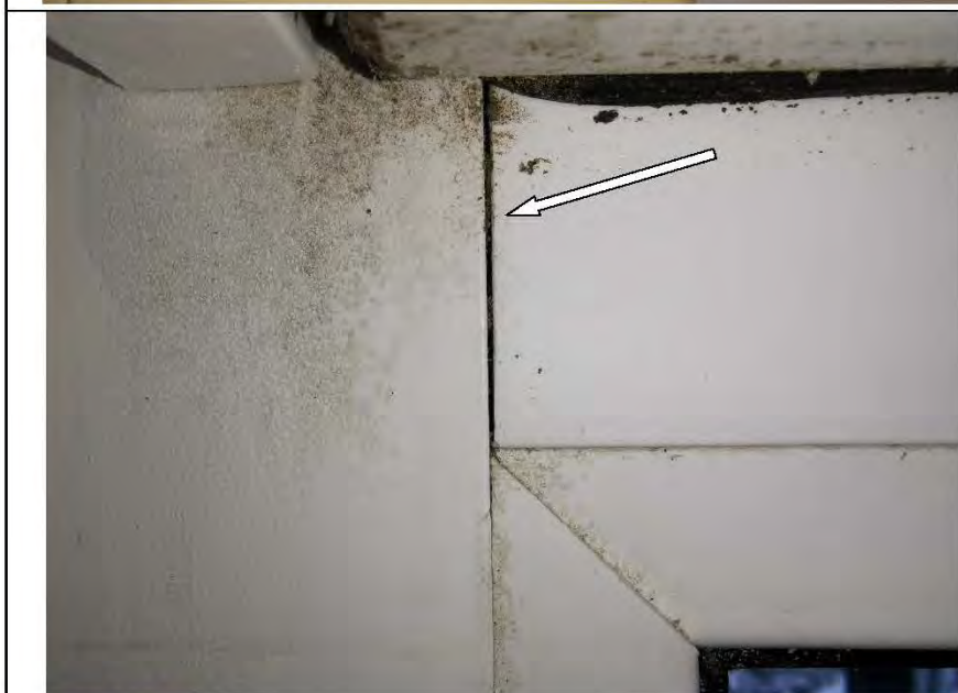
Фото №29. Зазор в месте стыка профилей ПВХ оконного блока в комнате.
