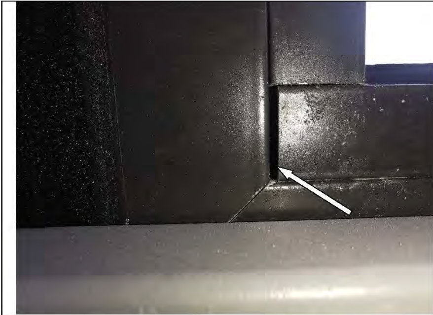
Фото №37. Дефект (зазор) на металлическом профиле оконного блока на балконе.
