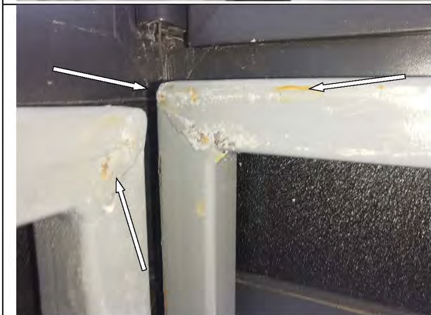
Фото №56. Следы коррозии на металлическом ограждении оконного блока на балконе.
