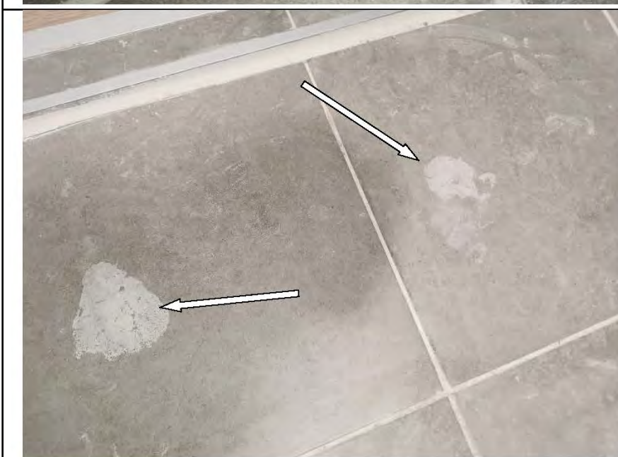
Фото №24. Загрязнение затирочным раствором напольной керамической плитки в санузле.
