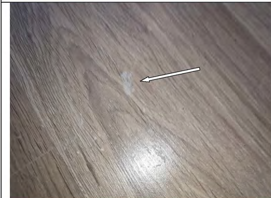
Фото №20. Загрязнение ламината в комнате.
