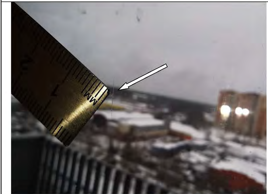
Фото №32. Царапины на стеклопакете оконного блока ПВХ в комнате.
