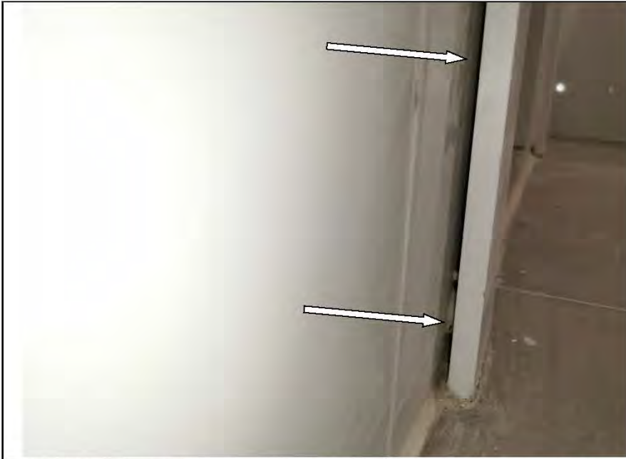
Фото №46. Неплотное прилегание дверного наличника к стене в санузле.
