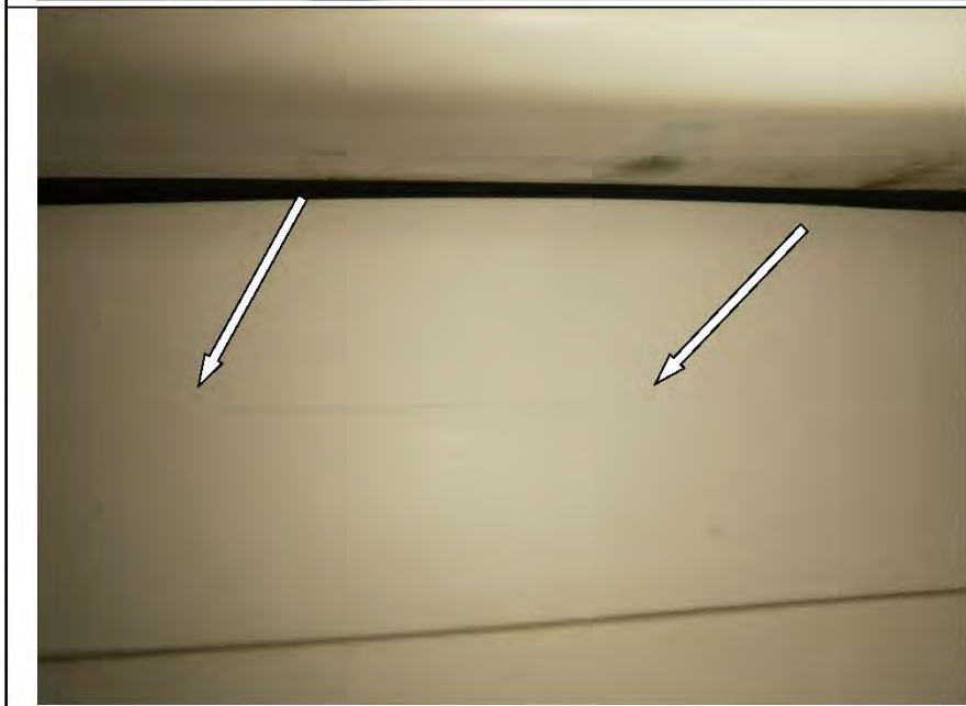
Фото №26. Царапины на профиле ПВХ оконного блока в комнате.
