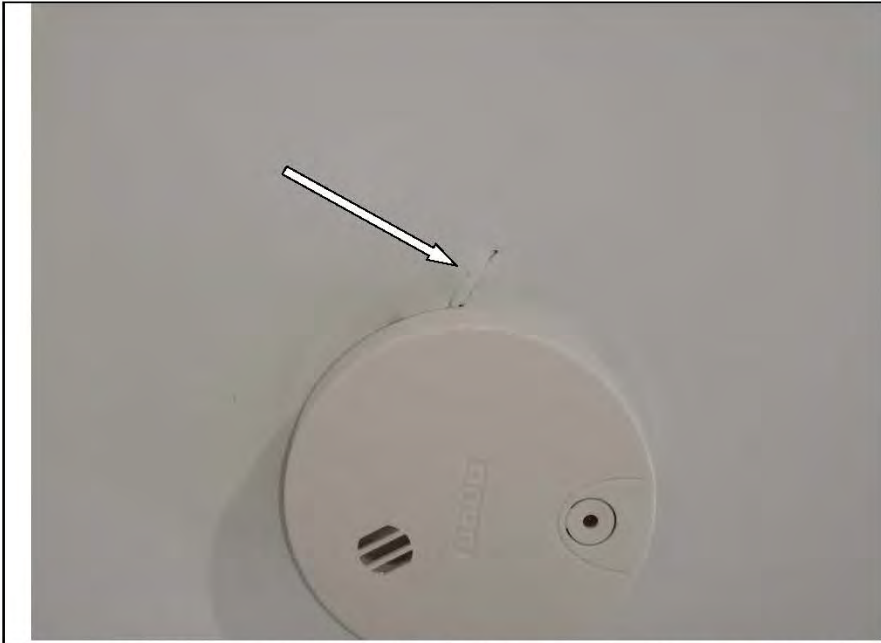
Фото №52. Разрыв полотна натяжного потолка в комнате.
