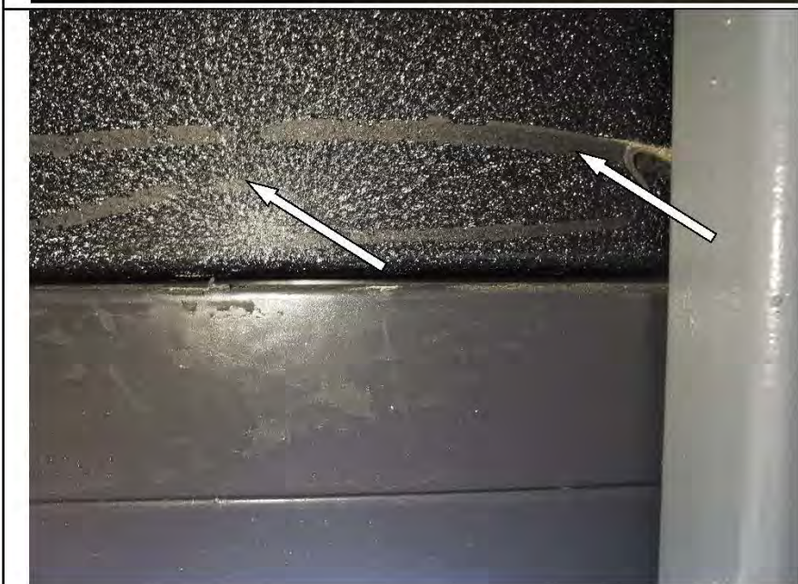
Фото №39. Потертости на профиле металлического оконного блока на балконе.
