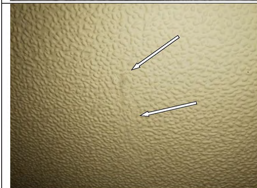
Фото №11. Потертости на поверхности обойного полотна в коридоре.
