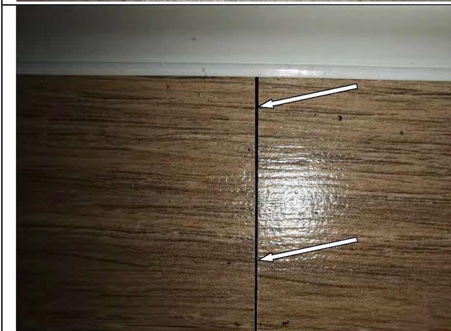
Фото №21. Зазор между соседними досками ламината в комнате.
