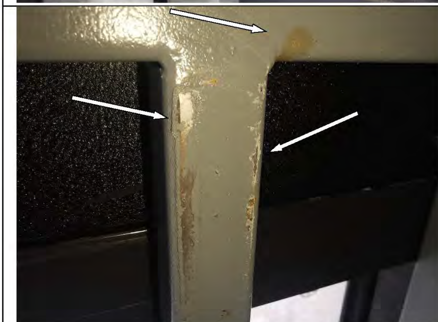
Фото №57. Окрашивание металлического ограждения оконного блока на балконе выполнено с дефектами (не прокрашено, следы коррозии)
