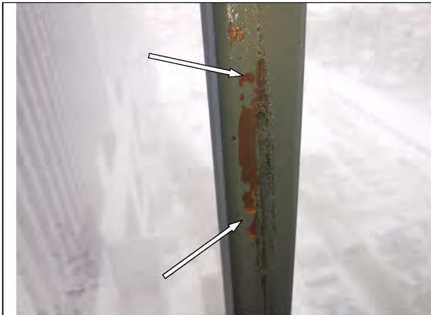
Фото №55. Следы коррозии на металлическом ограждении оконного блока на балконе.
