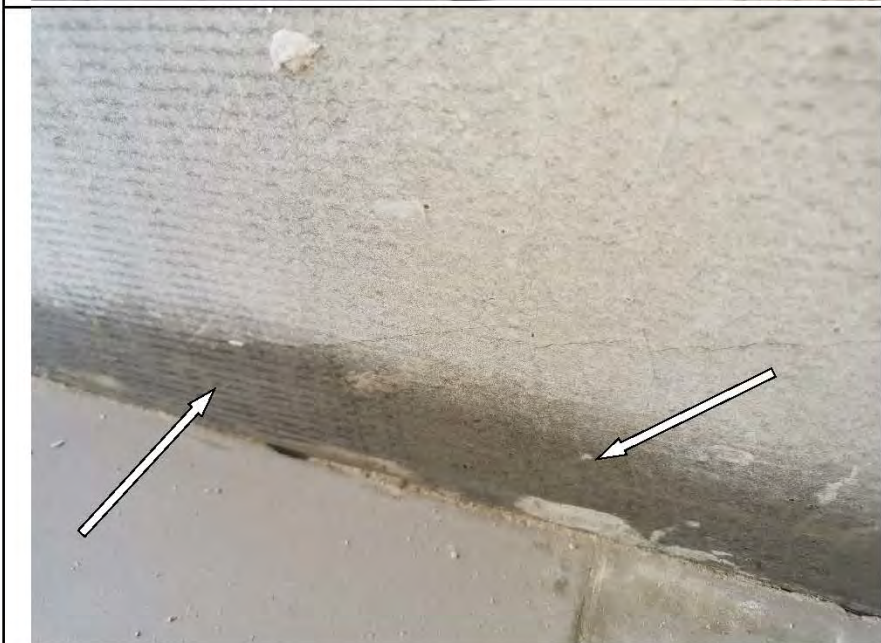
Фото №54. Некачественно выполнен монтаж настенных панелей на балконе.
