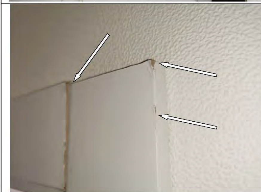
Фото №45. Повреждение ламинации наличников деревянного дверного блока в санузле.
