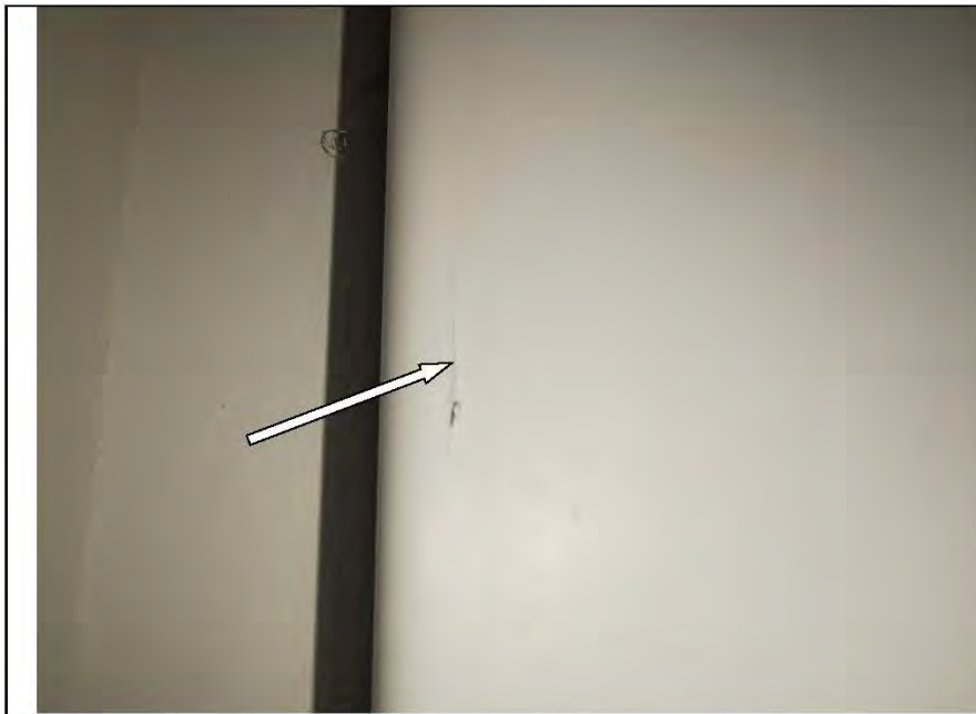
Фото №25. Царапины на профиле ПВХ оконного блока в комнате.
