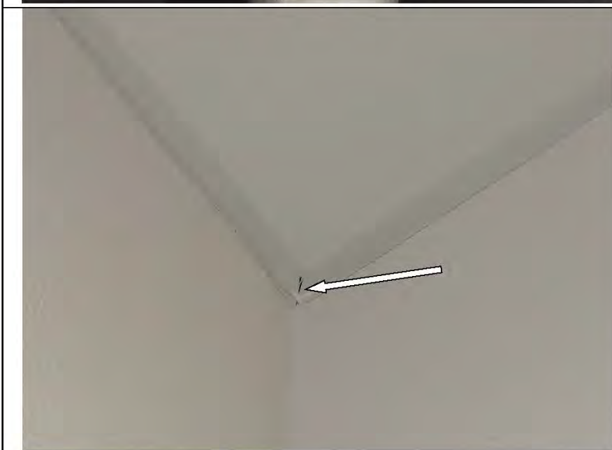
Фото №51. Дефект монтажа декоративного молдинга крепления натяжного потолка в комнате.
