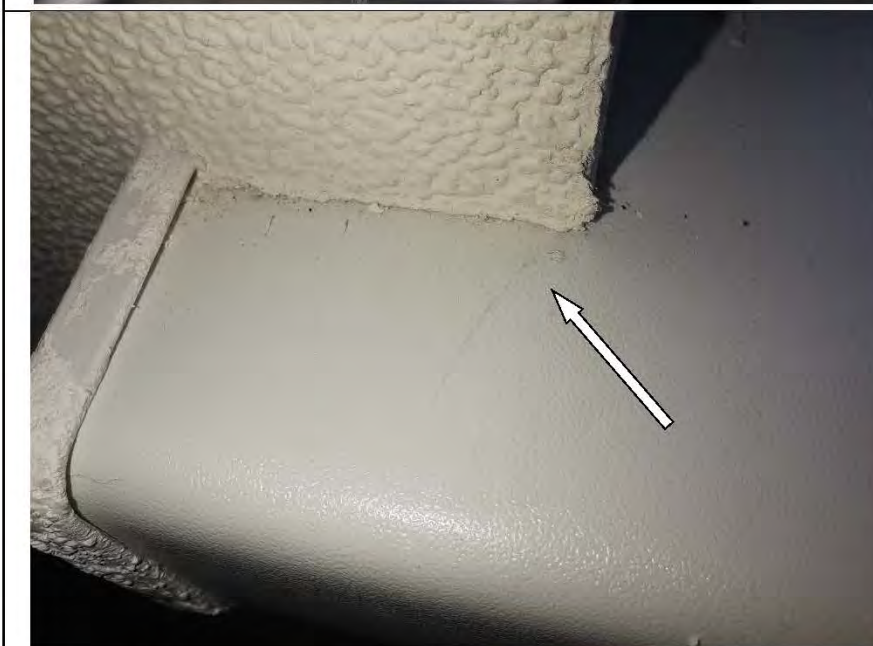
Фото №35. Царапины на лицевой поверхности подоконной доски в комнате.
