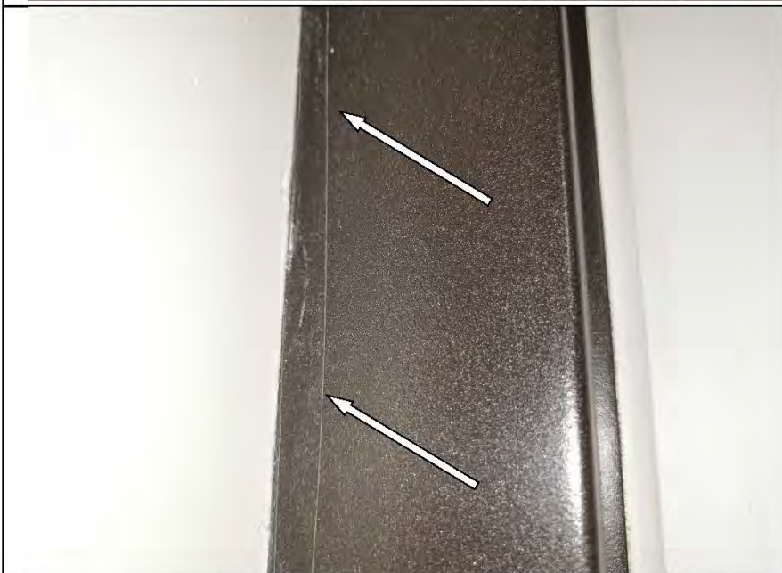
Фото №48. Царапины на металлическом коробе входного дверного блока.
