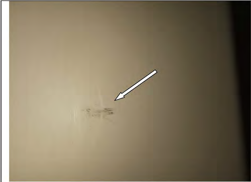
Фото №31. Потертости на профиле ПВХ дверного блока в комнате.
