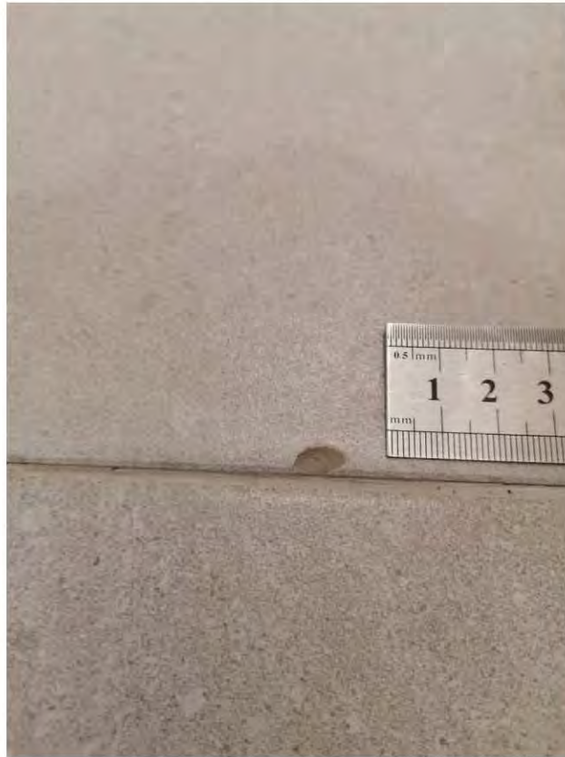
Фото 35. Кухня-Комната 3.4 Скол на напольном покрытии из керамической плитки
