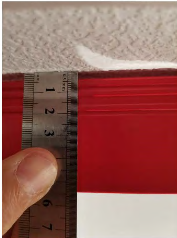
Фото 14-16. Коридор 1.4 Отклонения участков стен от горизонтали 8 мм, 5 мм, 4,5 мм, 5 мм
