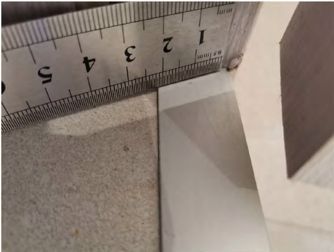
Фото 20-22. Санузел 2.2 На дверном блоке имеются сколы и отслоения ламинации
