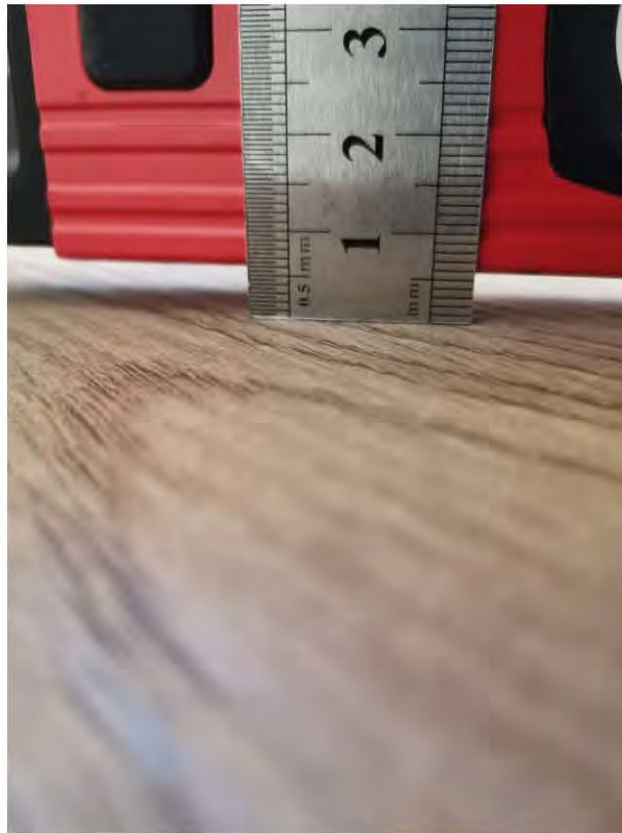
Фото 36. Кухня-Комната 3.5 Отклонение напольного покрытия из ламинированной доски от плоскости 6 мм
