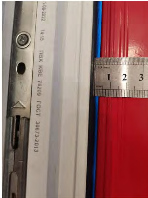
Фото 40. Кухня-Комната 3.8 Отклонение оконной створки оконного блока от плоскости 3,5 мм
