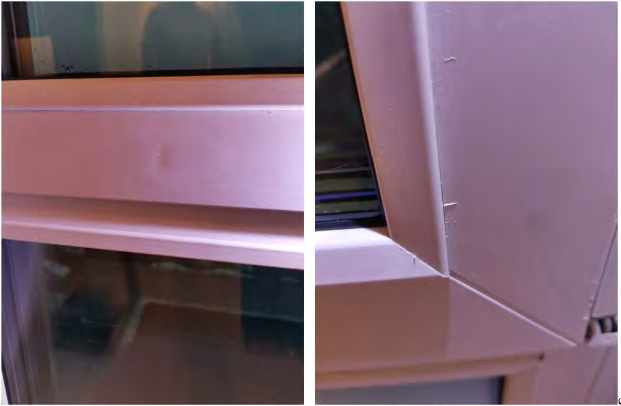
Фото 42, 43. Кухня-Комната 3.10 Наличие царапин и сколов на лицевой поверхности оконного блока
