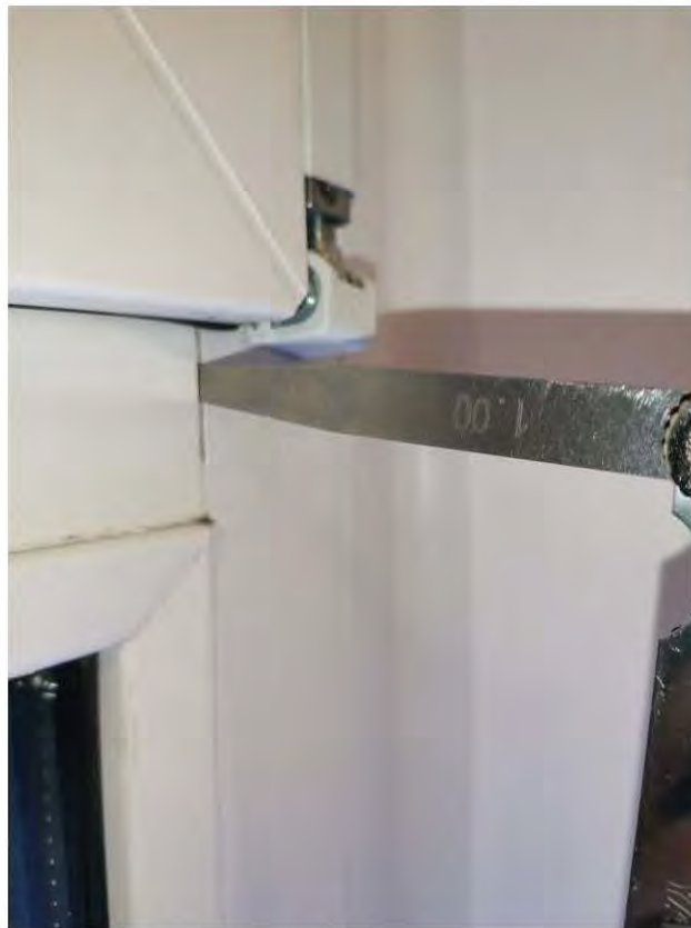
Фото 44. Кухня-Комната 3.11 Зазор 1 мм между элементами оконного блока
