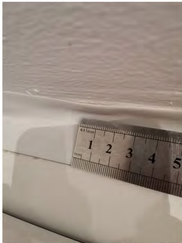
Фото 41. Кухня-Комната 3.9 Некачественная окраска оконных откосов: брызги, разводы
