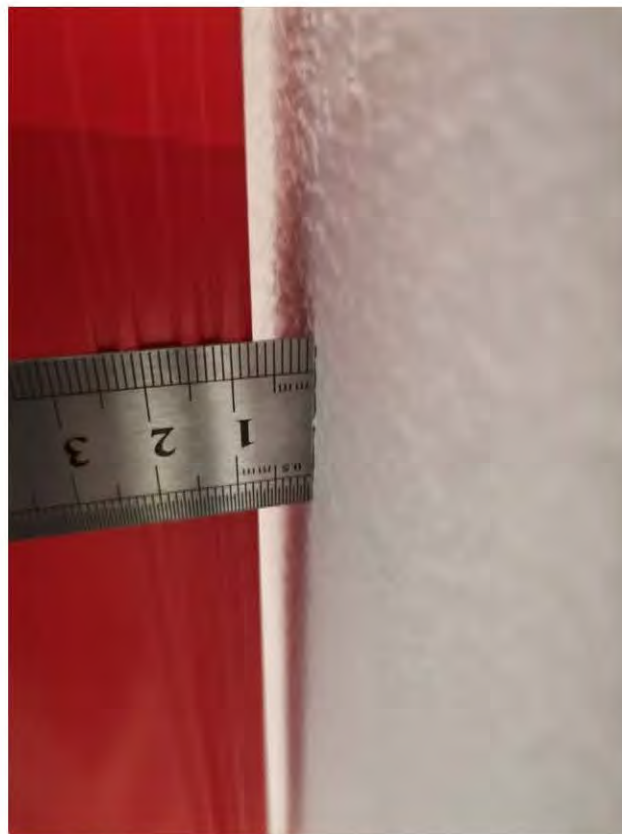
Фото 28-30. Кухня-Комната 3.1 Отклонения участков стен от горизонтали 4,5 мм, 5 мм,7,5 мм
