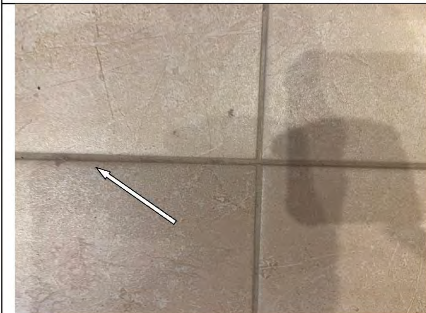
Фото №29. Загрязнения на напольном покрытии из ламината в кухне.
