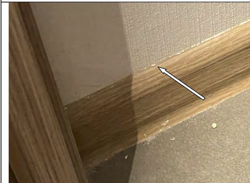
Фото №35. Неровности, выбоины, раковины на окрашенных откосах оконного блока ПВХ в спальне.
