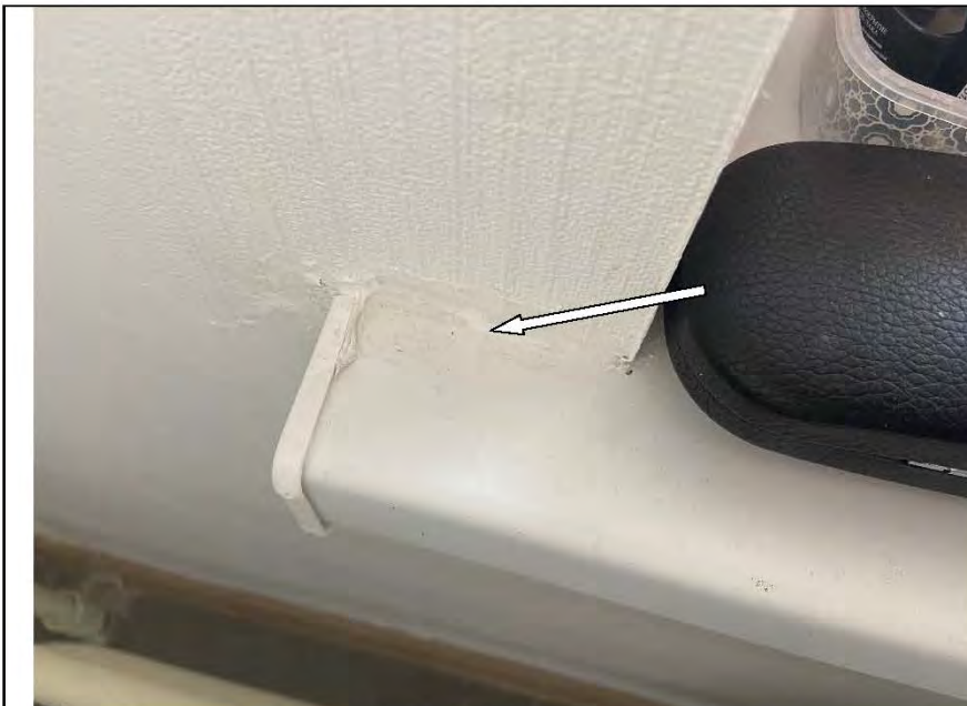
Фото №40. Дефект на алюминиевом профиле оконного блока на лоджии.
