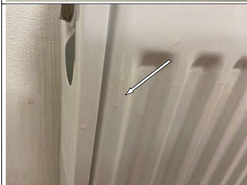
Фото №69. Загрязнения на металлическом кожухе отопительного прибора в коридоре.
