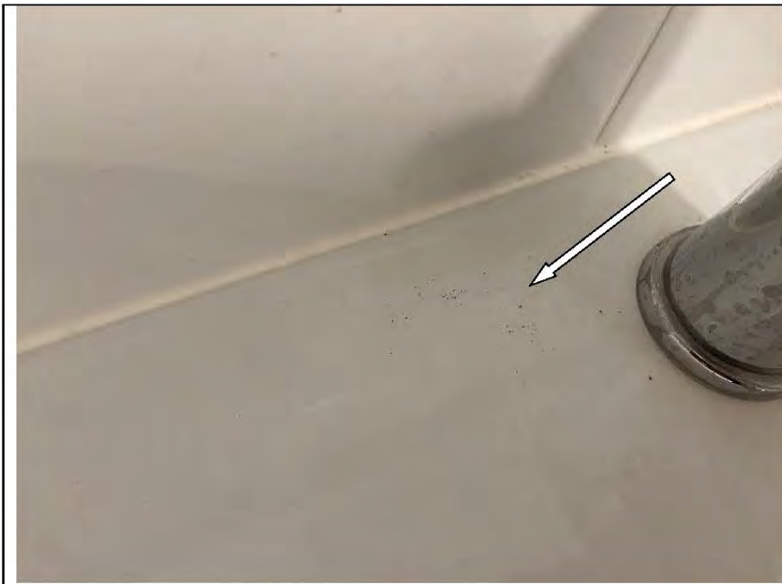
Фото №73. Окалины на раковине в ванной комнате.
