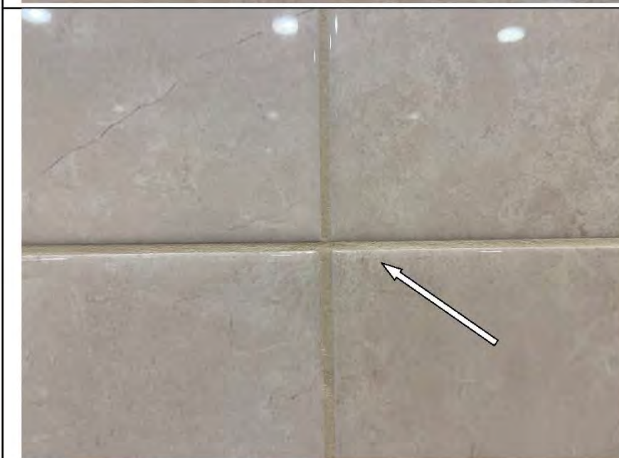
Фото №15. Отклонения напольного покрытия из керамической плитки в ванной комнате.
