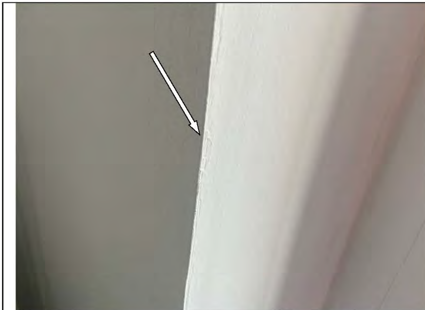
Фото №43. Царапина на стеклопакете оконного блока ПВХ на лоджии.
