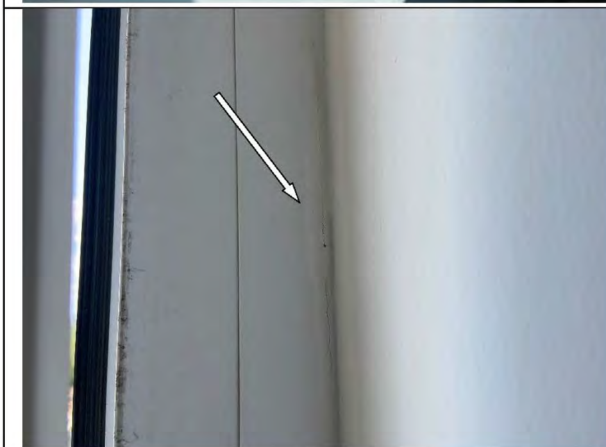
Фото №45. Не отрегулирована фурнитура оконного блока ПВХ в кухне.
