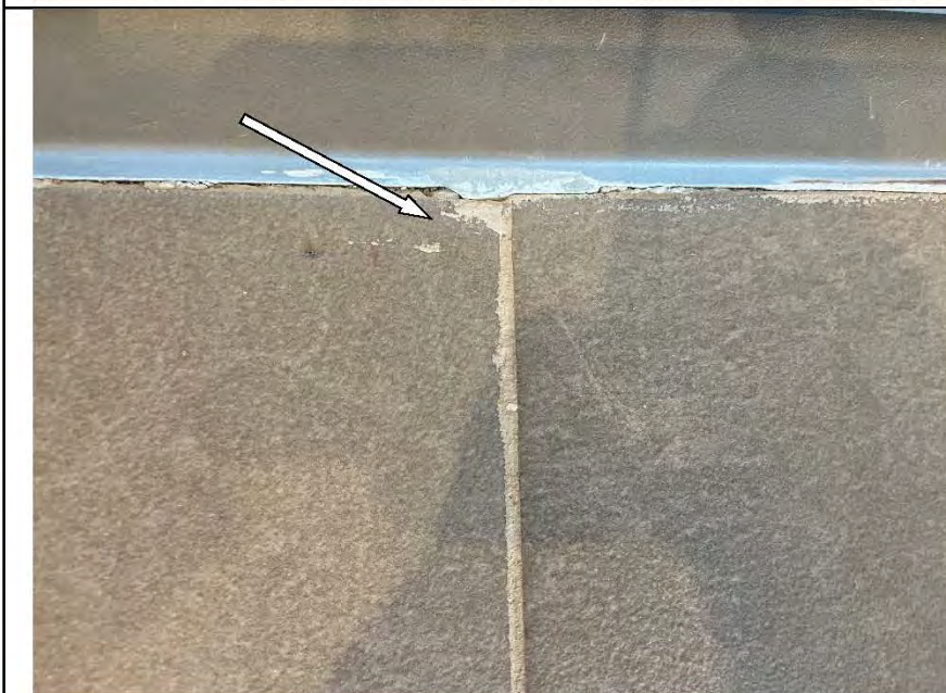
Фото №23. Неровные швы напольной керамической плитки на лоджии.
