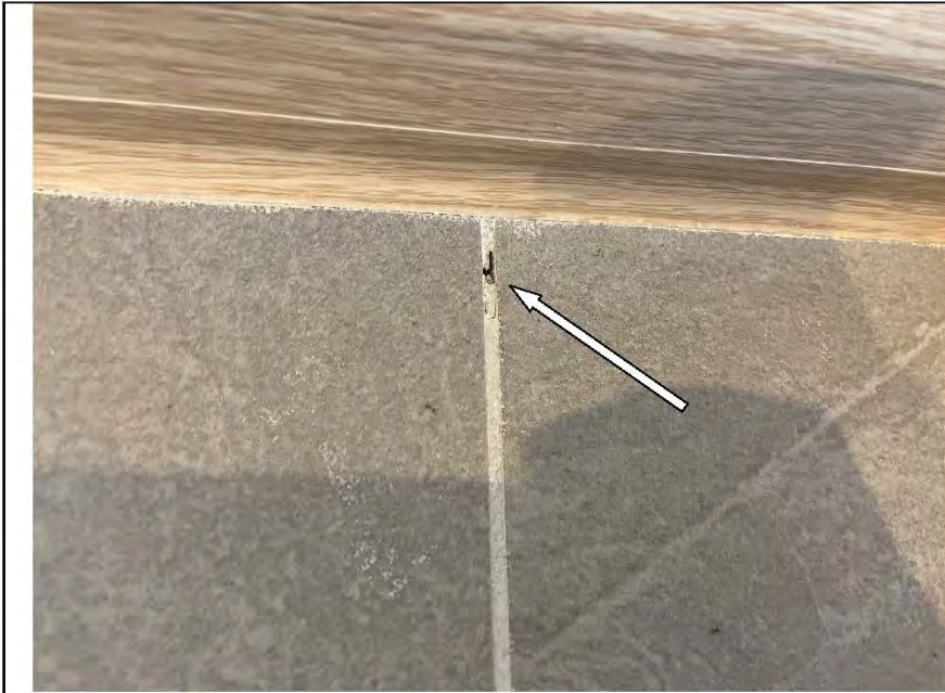
Фото №28. Загрязнения на напольном покрытии из ламината в спальне.
