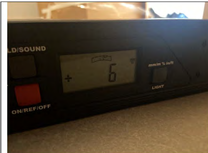
Фото №19. Отклонения напольного покрытия из ламината в кухне.
