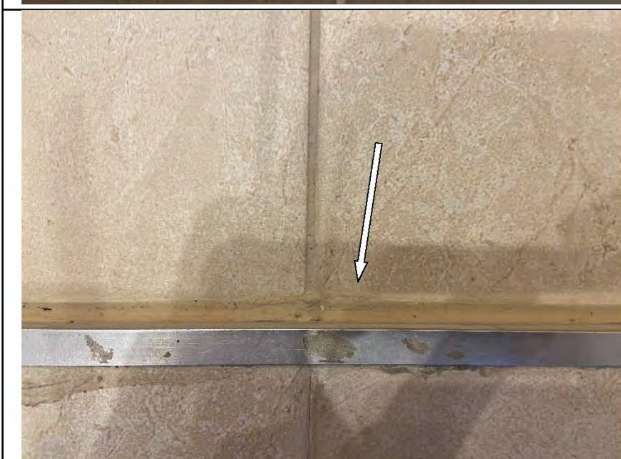
Фото №27. Загрязнения на напольном покрытии из ламината в коридоре.
