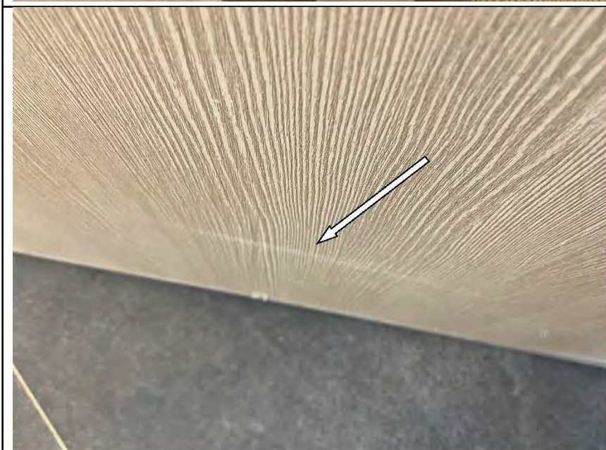
Фото №57. Загрязнения на наличнике деревянного дверного блока в кухне.
