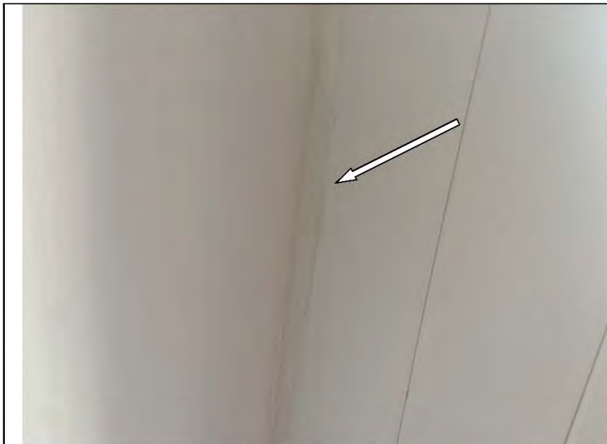
Фото №46. Отклонения поверхности по вертикали оконного блока ПВХ в спальне.
