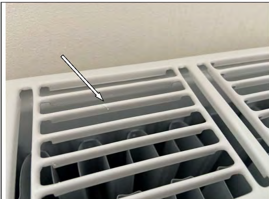
Фото №70. Загрязнения на металлическом кожухе отопительного прибора в спальне.
