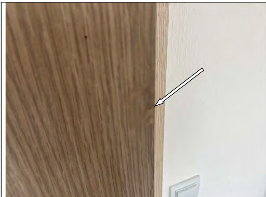
Фото №61. Загрязнения на коробке деревянного дверного блока в кухне.
