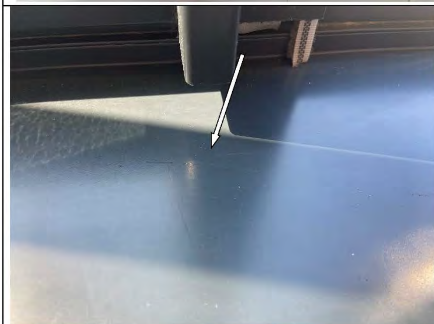
Фото №47. Отклонения поверхности по вертикали оконного блока ПВХ в кухне.
