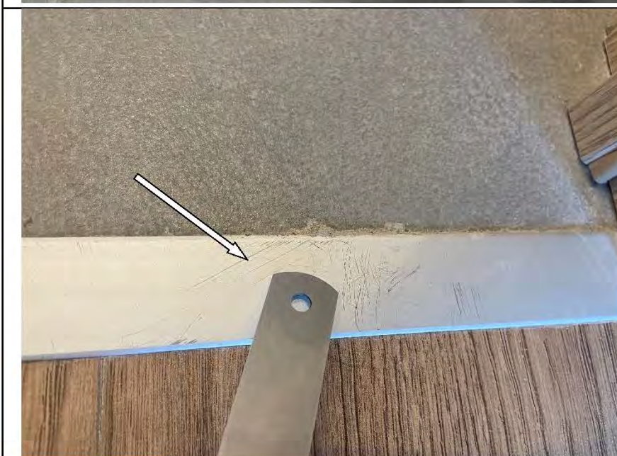
Фото №39. Дефект на алюминиевом профиле оконного блока на лоджии.
