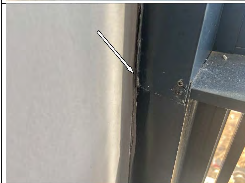
Фото №48. Загрязнения на коробке входного дверного блока в коридоре.
