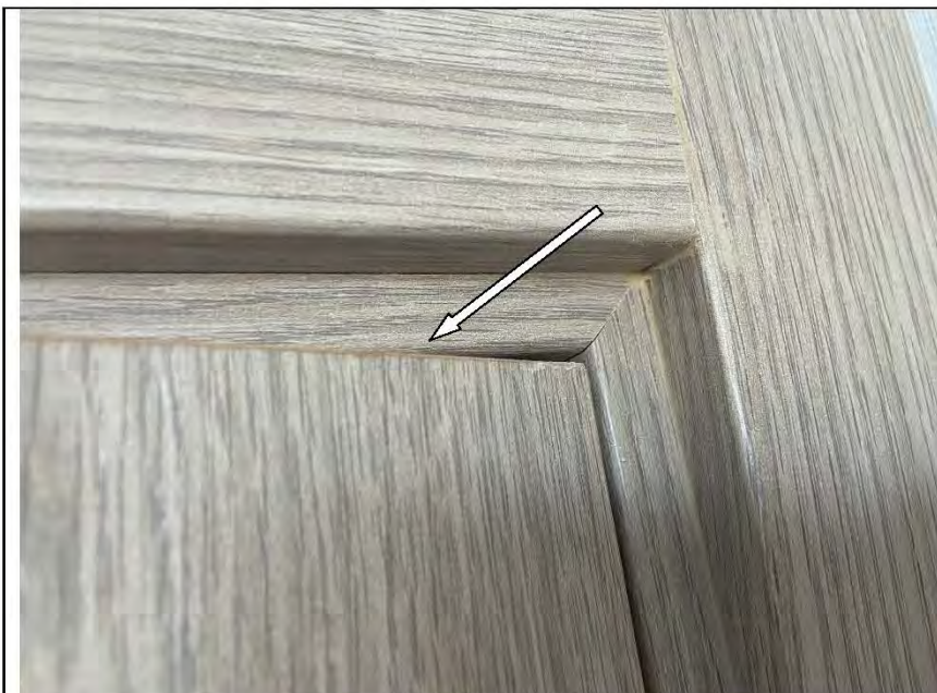
Фото №58. Загрязнения на коробке деревянного дверного блока в спальне.
