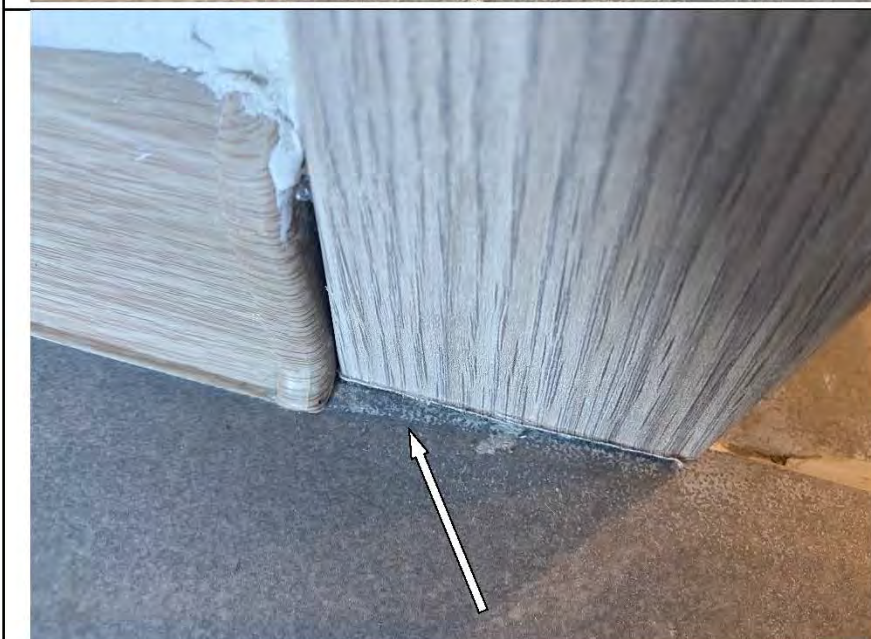
Фото №24. Загрязнения на напольном плинтусе ПВХ в коридоре.
