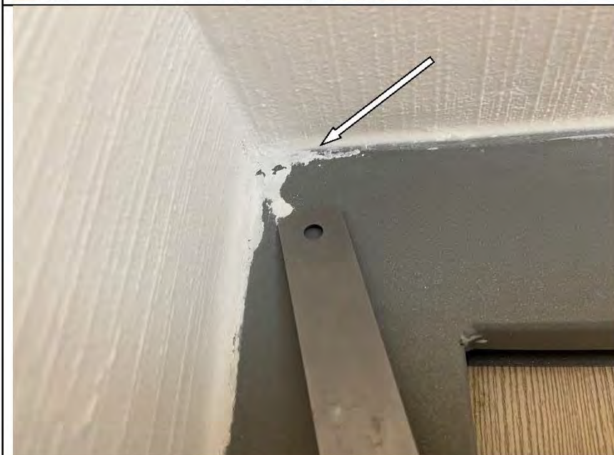
Фото №56. Загрязнения на наличнике деревянного дверного блока в ванной комнате.
