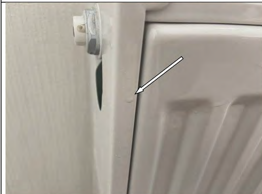
Фото №71. Загрязнения на металлическом кожухе отопительного прибора в кухне.
