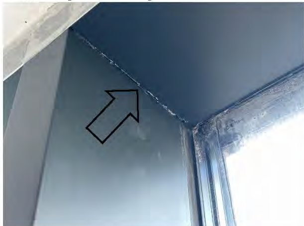
Фото №19. Оконные блоки из алюминиевых профилей имеют царапины, следы загрязнения строительными смесями.
