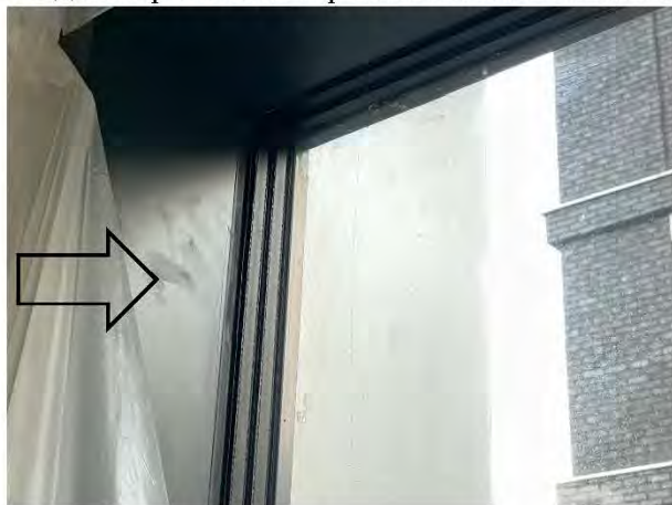
Фото №24. Оконные блоки из алюминиевых профилей имеют царапины, следы загрязнения строительными смесями.
