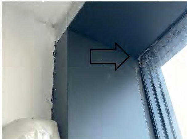
Фото №20. Оконные блоки из алюминиевых профилей имеют царапины, следы загрязнения строительными смесями.
