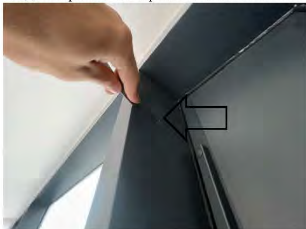
Фото №23. Оконные блоки из алюминиевых профилей имеют царапины, следы загрязнения строительными смесями.
