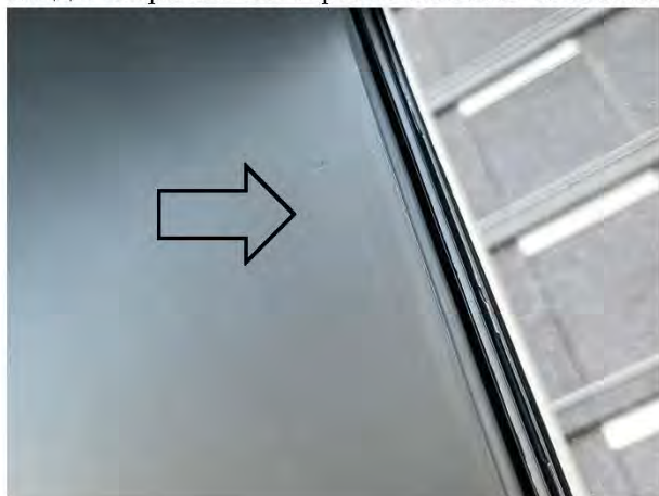
Фото №22. Оконные блоки из алюминиевых профилей имеют царапины, следы загрязнения строительными смесями.
