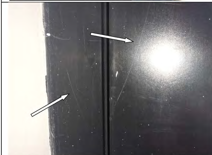
Фото №35. Царапины на профиле металлического оконного блока в кухне.
