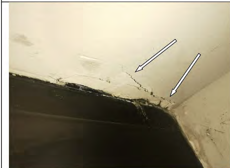
Фото №14. Дефекты в месте примыкания металлического блока в кухне (инфильтрация, трещины, разрушение штукатурного слоя).
