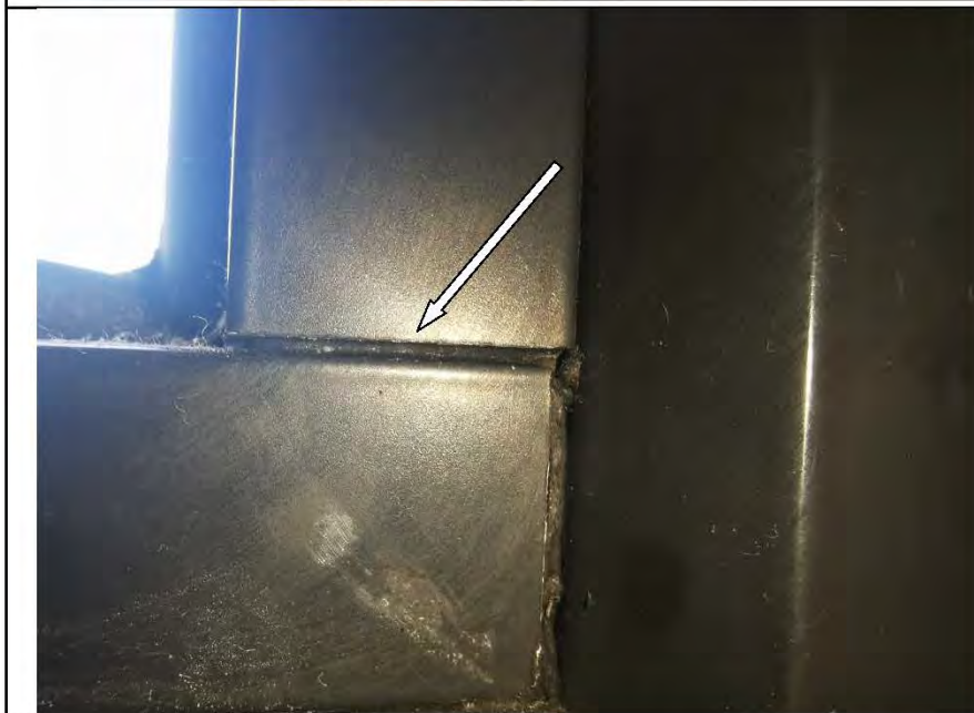
Фото №50. Зазор в месте стыка профилей металлического оконного блока в кухне.
