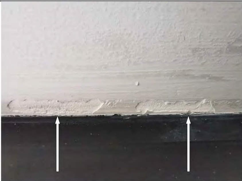
Фото №5. Дефекты в месте примыкания металлического блока в спальне (инфильтрация, трещины, разрушение штукатурного слоя).
