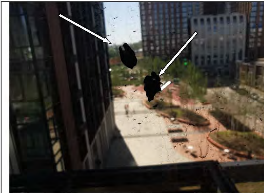
Фото №58. Загрязнения на стеклопакете металлического оконного блока в спальне.
