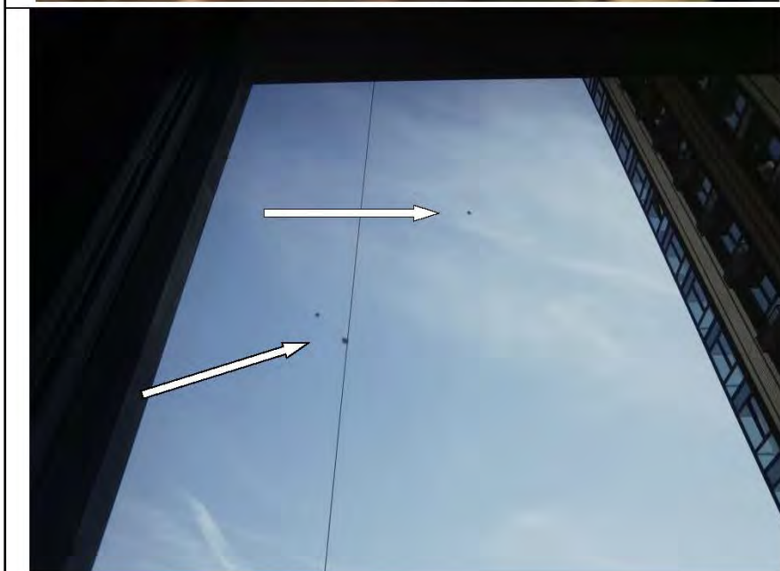
Фото №57. Загрязнения на стеклопакете металлического оконного блока в детской.
