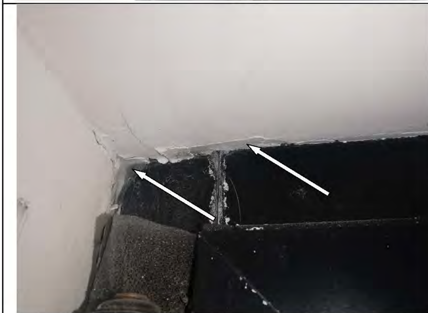
Фото №23. Дефекты в месте примыкания металлического блока в детской (инфильтрация, трещины, разрушение штукатурного слоя).
