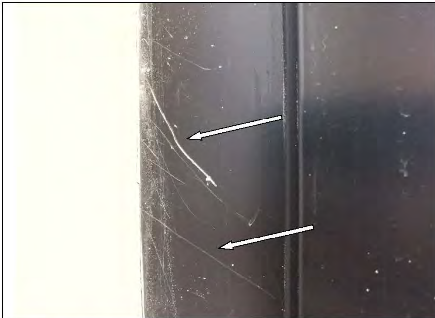
Фото №46. Царапины на профиле металлического оконного блока в спальне.
