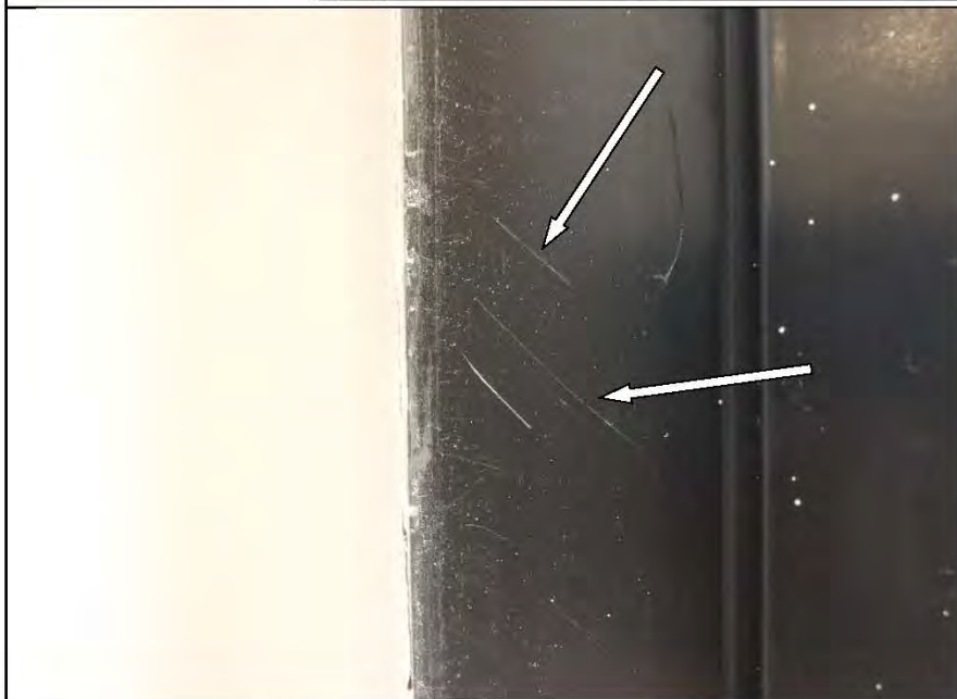
Фото №47. Царапины на профиле металлического оконного блока в спальне.
