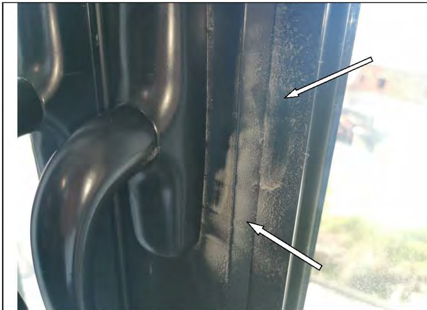
Фото №28. Загрязнения на профиле металлического оконного блока в кухне.
