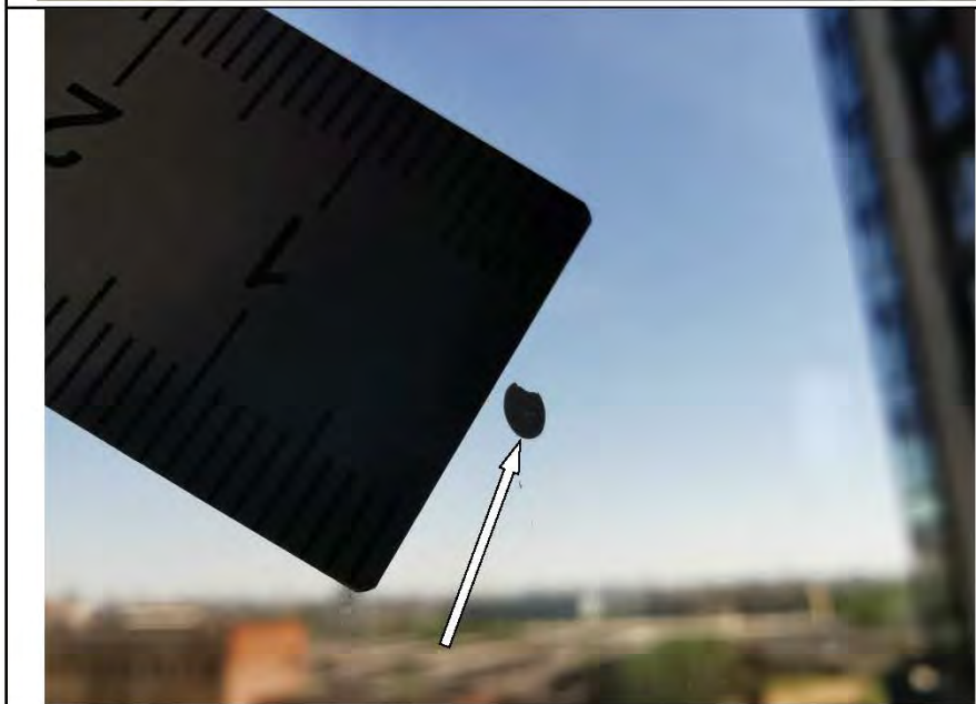
Фото №56. Загрязнения на стеклопакете металлического оконного блока в детской.
