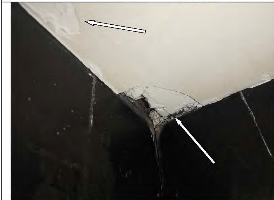
Фото №26. Дефекты в месте примыкания металлического блока в детской (инфильтрация, трещины, разрушение штукатурного слоя).
