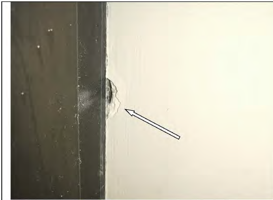
Фото №13. Дефекты в месте примыкания металлического блока в кухне (инфильтрация, трещины, разрушение штукатурного слоя).
