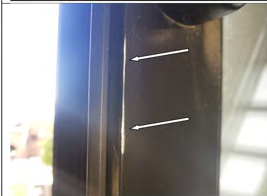
Фото №27. Потертости на профиле металлического оконного блока в кухне.
