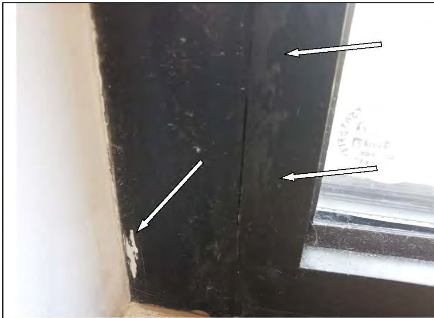
Фото №49. Загрязнения на профиле металлического оконного блока в спальне.
