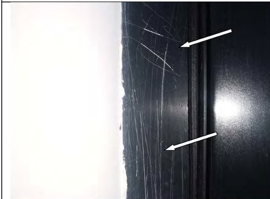
Фото №38. Царапины на профиле металлического оконного блока в детской.
