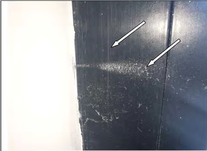
Фото №31. Загрязнения и царапины на профиле металлического оконного блока в кухне.
