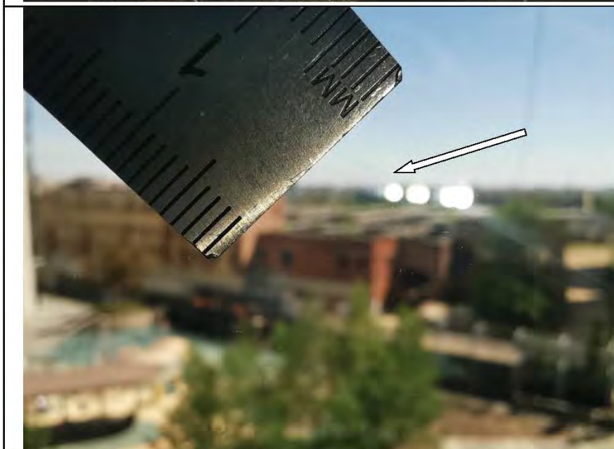
Фото №51. Царапины на стеклопакете металлического оконного блока в кухне.
