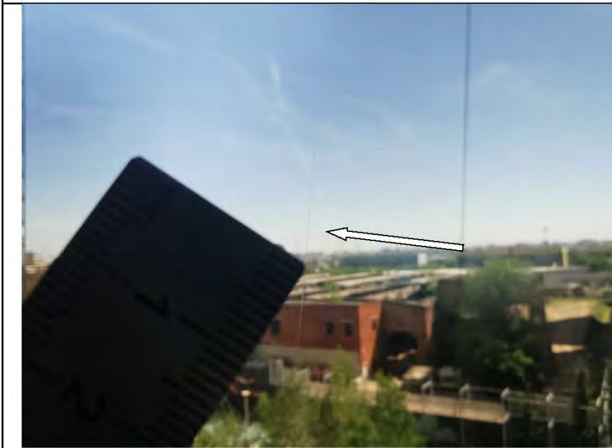
Фото №53. Царапины на стеклопакете металлического оконного блока в кухне.
