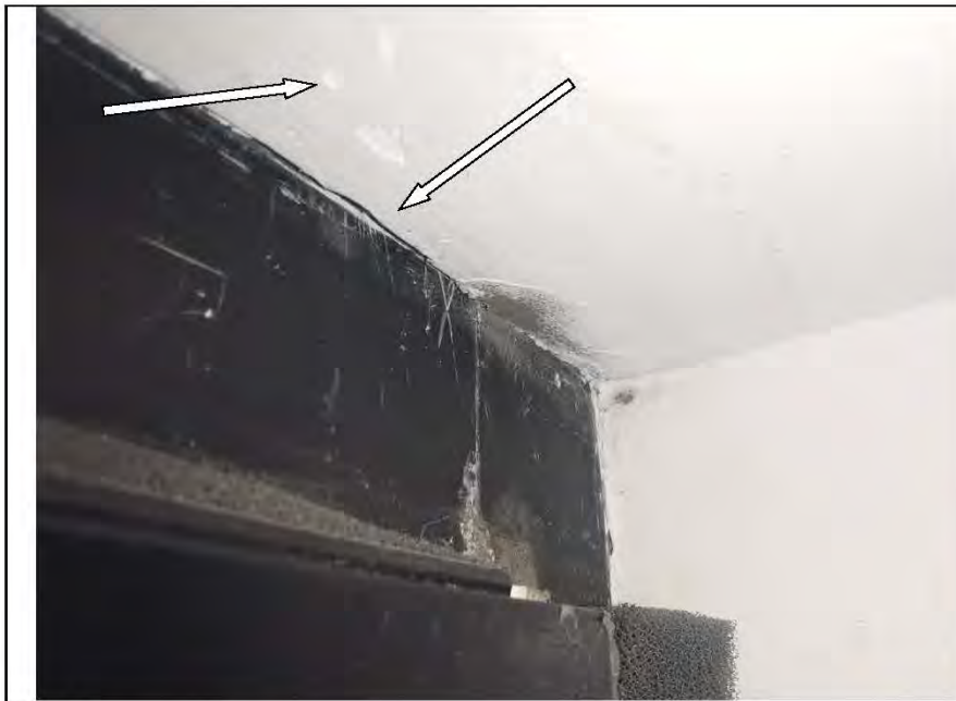
Фото №25. Дефекты в месте примыкания металлического блока в детской (инфильтрация, трещины, разрушение штукатурного слоя).
