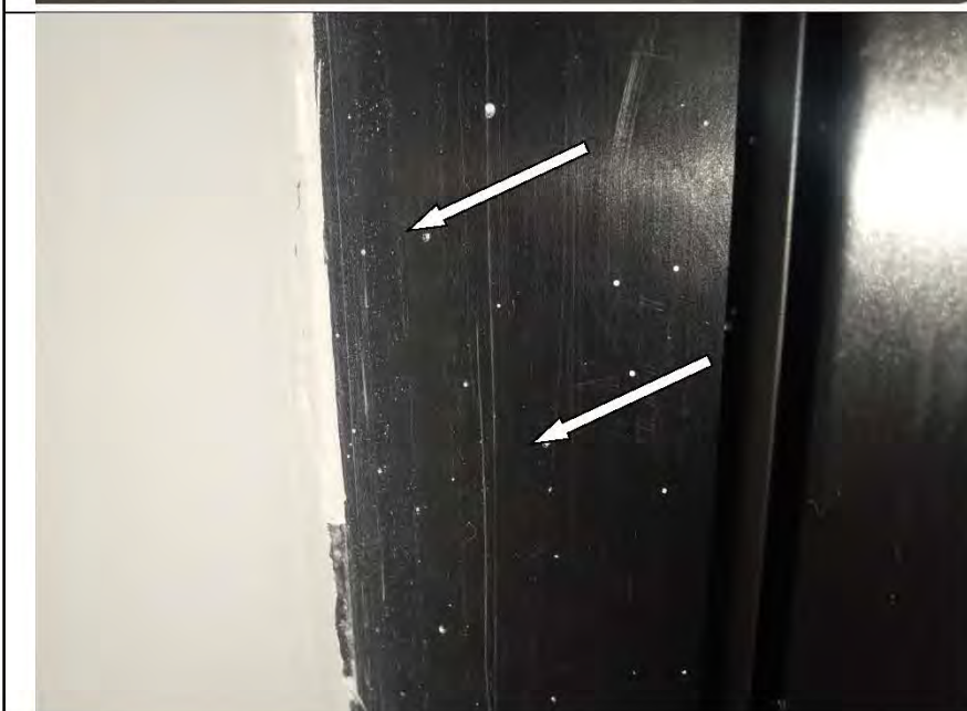
Фото №33. Загрязнения и царапины на профиле металлического оконного блока в кухне.
