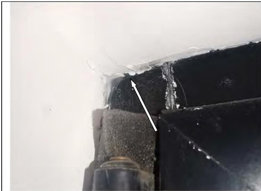
Фото №22. Дефекты в месте примыкания металлического блока в детской (инфильтрация, трещины, разрушение штукатурного слоя).
