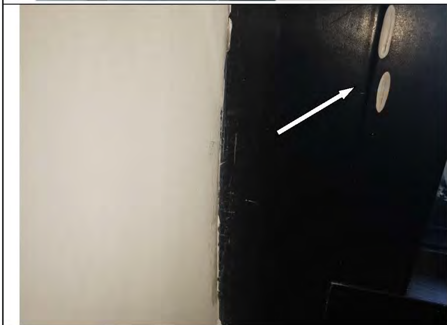
Фото №30. Загрязнения на профиле металлического оконного блока в кухне.
