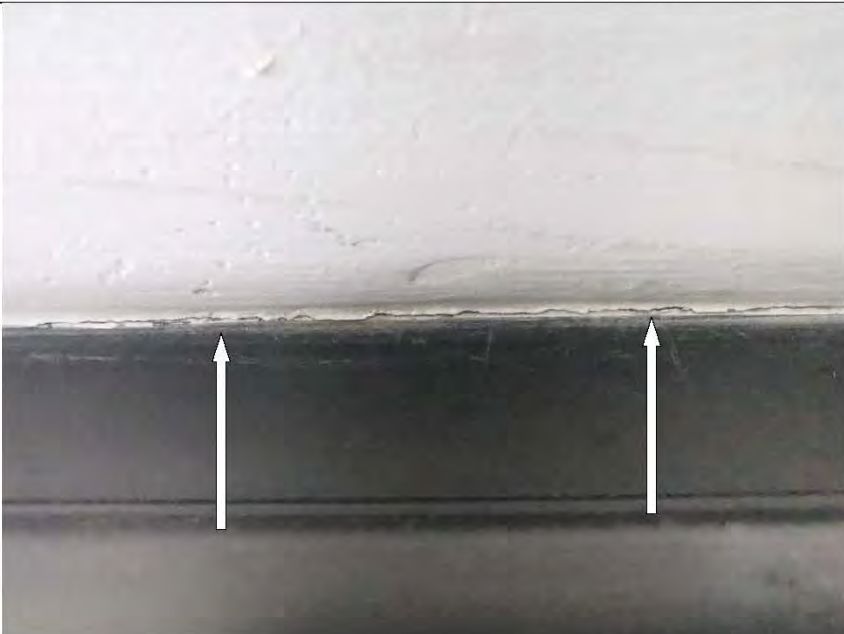
Фото №6. Дефекты в месте примыкания металлического блока в спальне (инфильтрация, трещины, разрушение штукатурного слоя).
