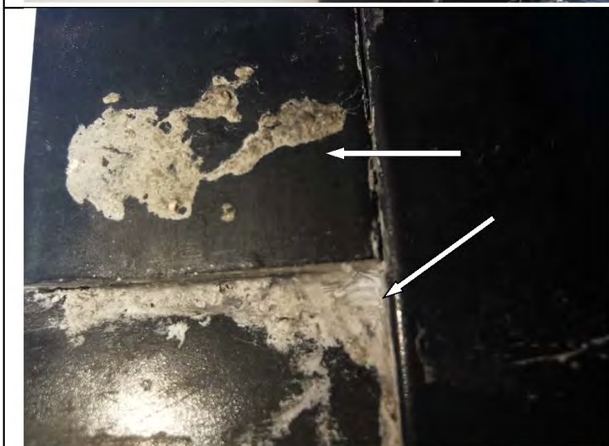
Фото №41. Загрязнения на профиле металлического оконного блока в детской.
