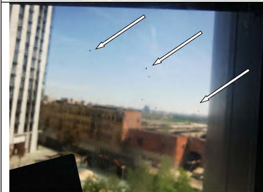
Фото №54. Окалины на стеклопакете металлического оконного блока в кухне.
