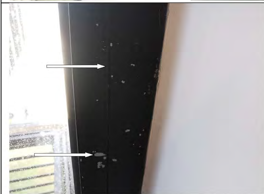
Фото №45. Загрязнения на профиле металлического оконного блока в спальне.
