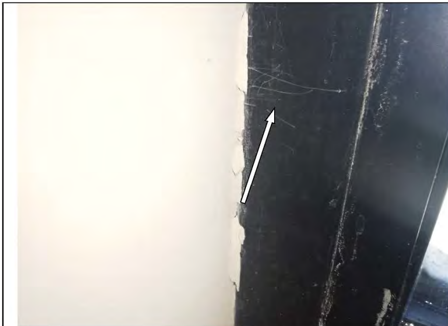
Фото №40. Царапины на профиле металлического оконного блока в детской.
