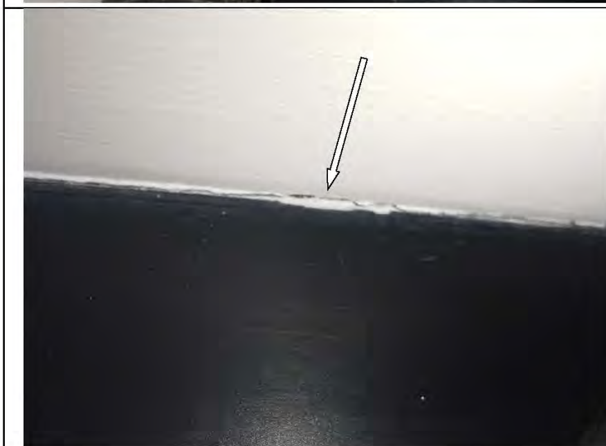
Фото №24. Дефекты в месте примыкания металлического блока в детской (инфильтрация, трещины, разрушение штукатурного слоя).
