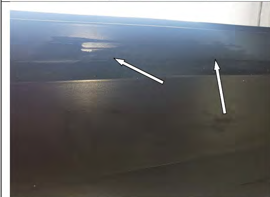
Фото №32. Загрязнения на профиле металлического оконного блока в кухне.
