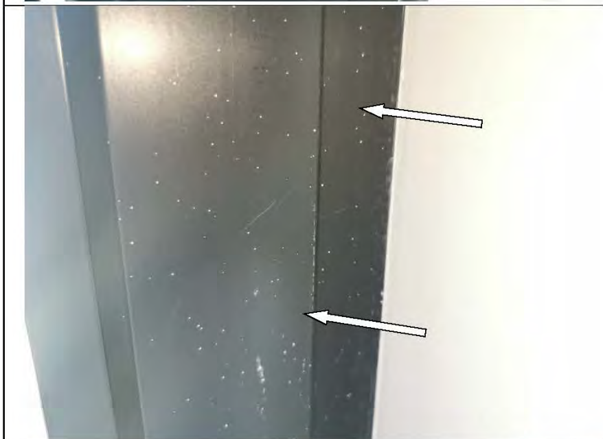
Фото №29. Загрязнения на профиле металлического оконного блока в кухне.
