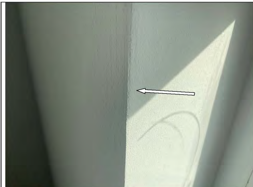
Фото №79. Неровности, выбоины, раковины на окрашенных откосах оконного блока ПВХ в кабинете.
