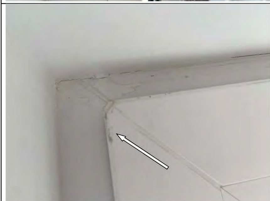
Фото №65. Дефект на профиле оконного блока ПВХ в спальне.
