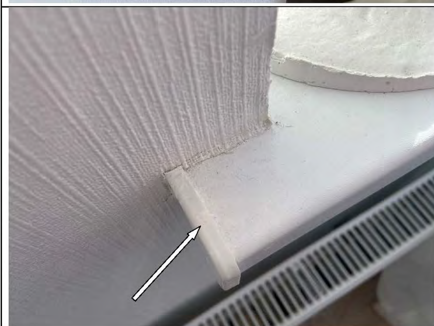
Фото №57. Царапина на лицевой стороне подоконной доски в спальне.
