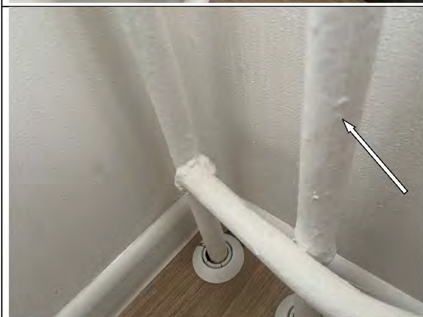
Фото №104. Неровности, подтеки на окрашенных трубах отопления в спальне.
