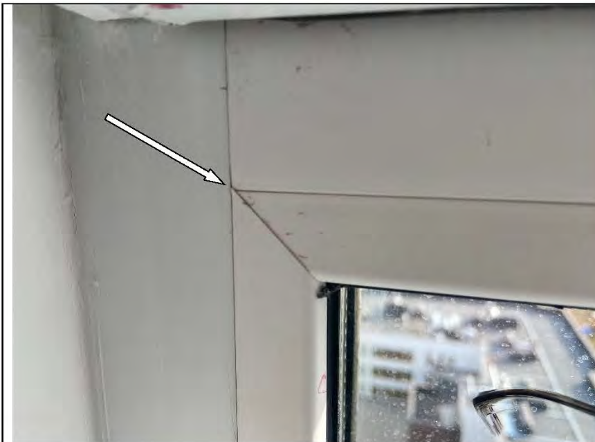
Фото №64. Дефект на профиле оконного блока ПВХ в спальне.
