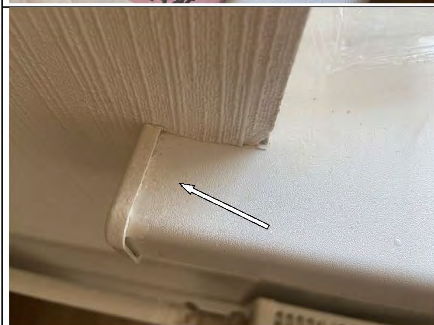
Фото №51. Царапина на лицевой стороне подоконной доски в кухне.
