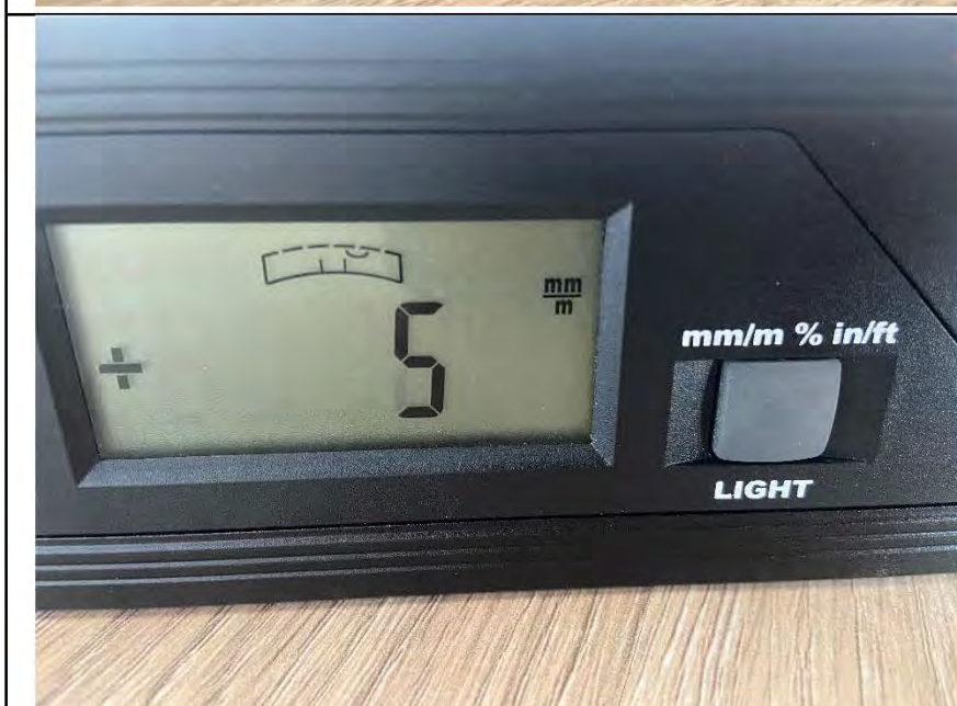
Фото №20. Отклонение поверхности напольного покрытия из ламината в кухне.
