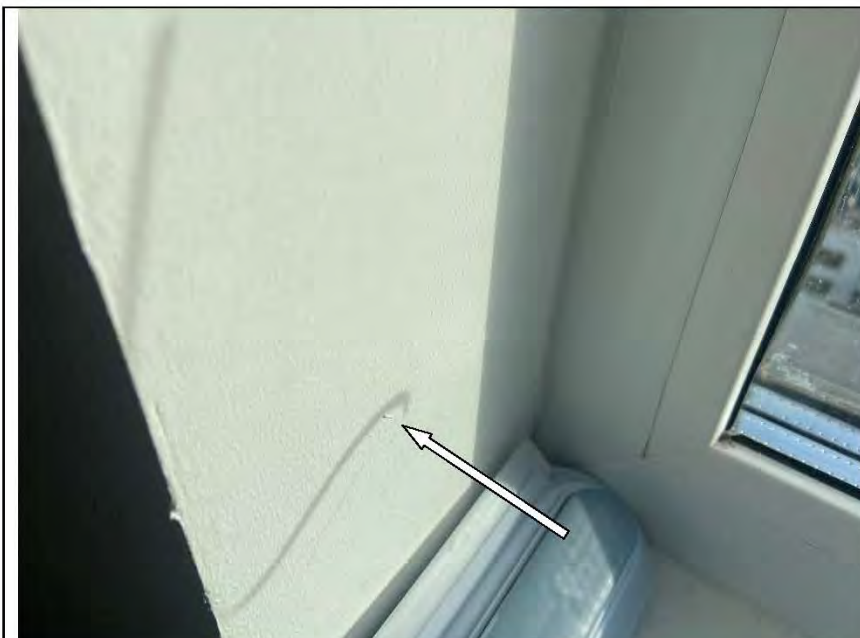
Фото №82. Неровности, выбоины, раковины на окрашенных откосах оконного блока ПВХ в спальне.
