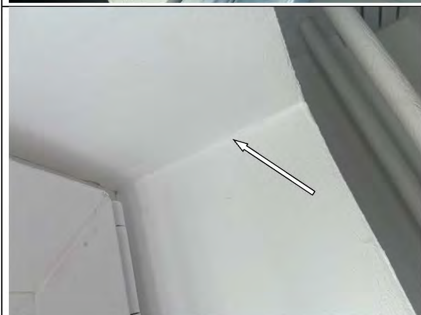
Фото №83. Неровности, выбоины, раковины на окрашенных откосах оконного блока ПВХ в спальне.
