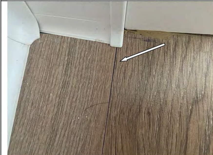
Фото №41. Зазоры между досками ламината в спальне.
