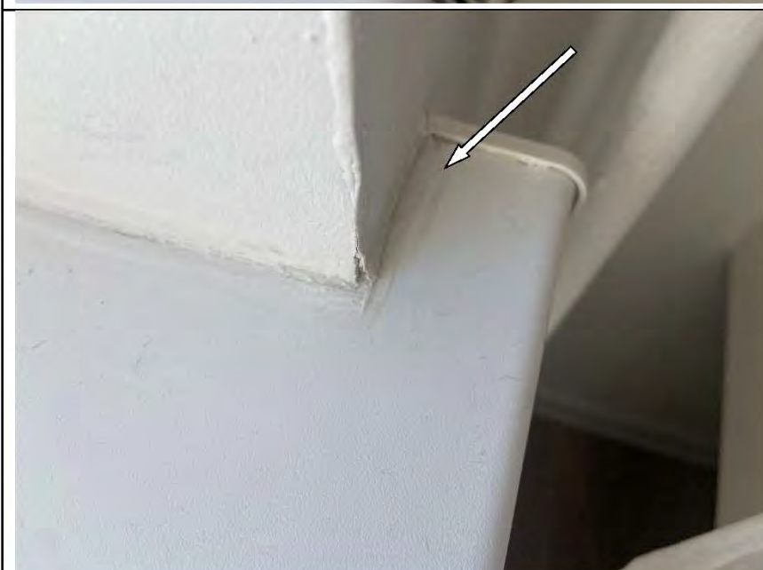
Фото №56. Царапина на лицевой стороне подоконной доски в спальне.
