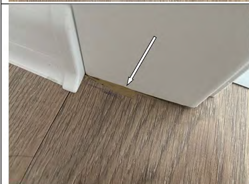
Фото №39. Коротко подрезан ламинат на стыке элементов в спальне.
