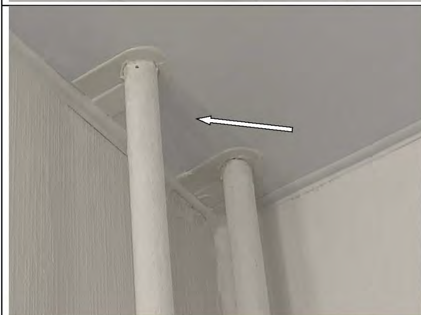
Фото №125. Дефект на поверхности натяжного потолка в кабинете.
