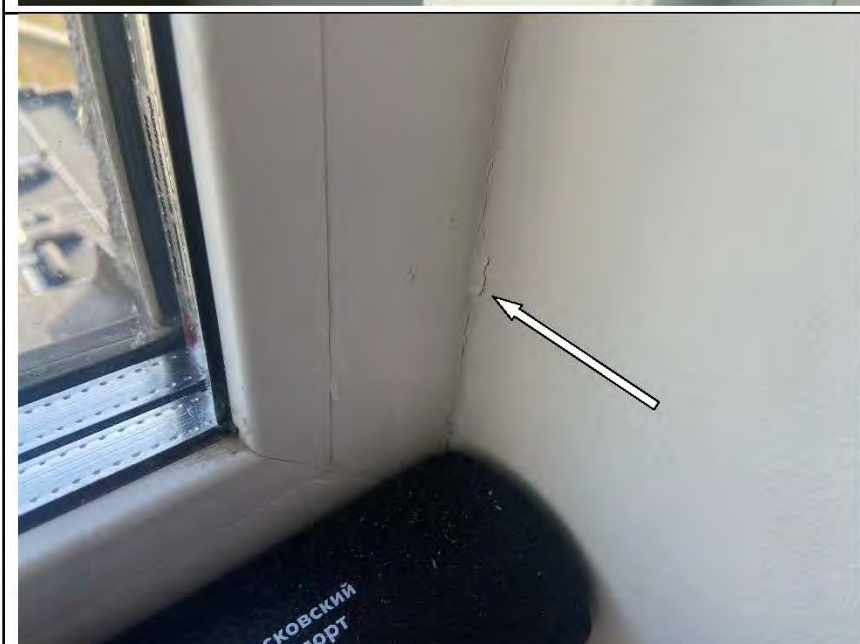
Фото №80. Неровности, выбоины, раковины на окрашенных откосах оконного блока ПВХ в кабинете.
