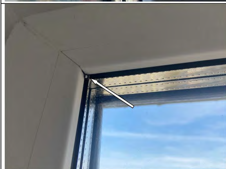
Фото №98. Дефект на уплотнительной ленте оконного блока ПВХ в спальне.
