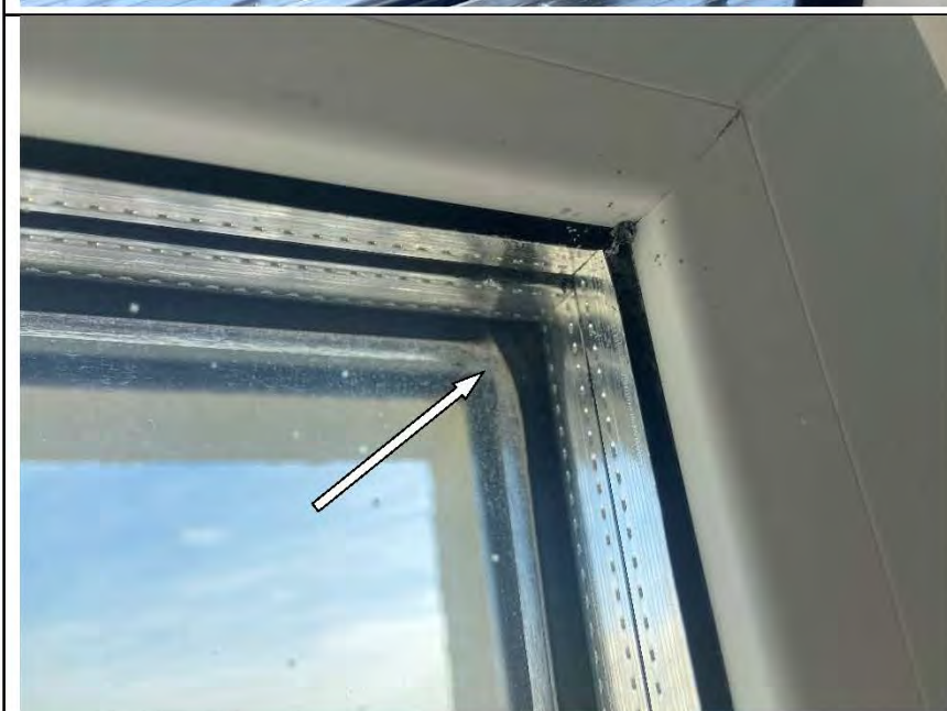
Фото №96. Дефект на уплотнительной ленте оконного блока ПВХ в кабинете.
