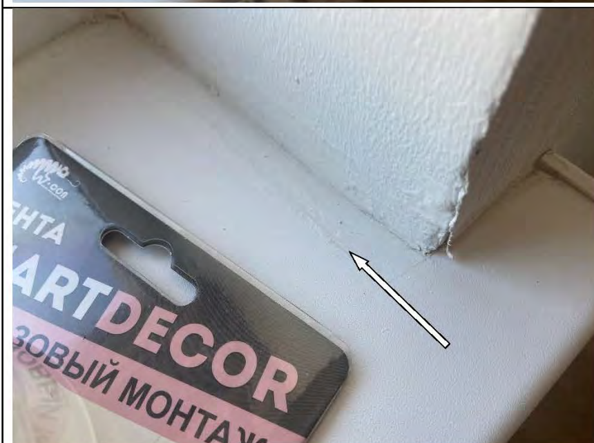
Фото №50. Царапина на лицевой стороне подоконной доски в кухне.
