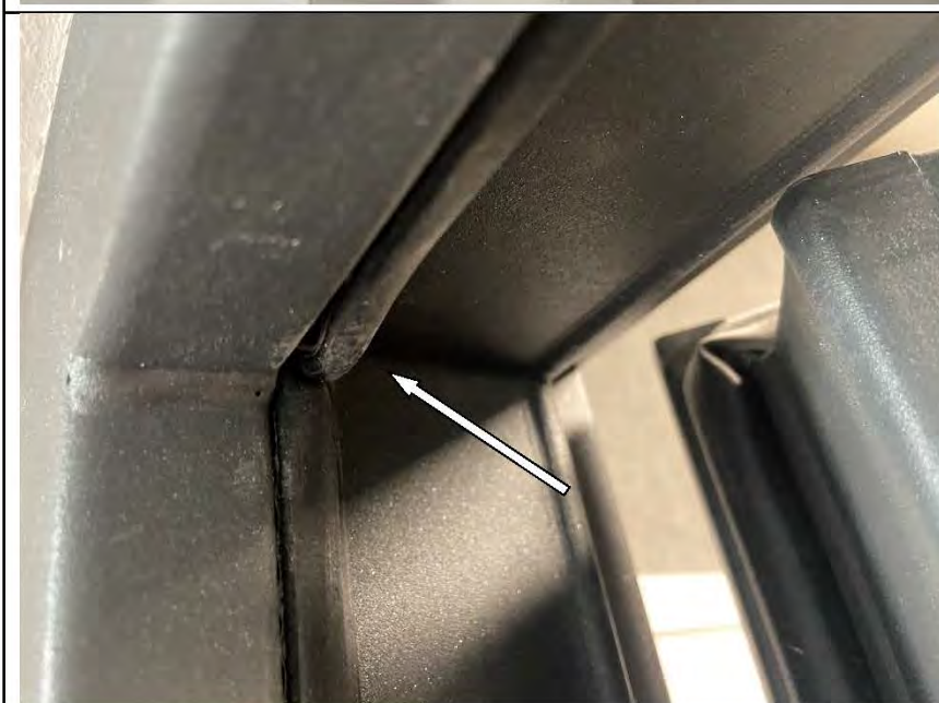
Фото №120. Дефект на уплотнительной противопожарной ленте входного дверного блока в коридоре.
