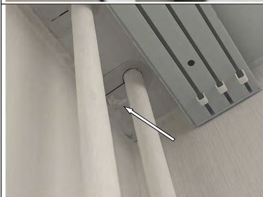
Фото №122. Дефект на поверхности натяжного потолка в кухне.
