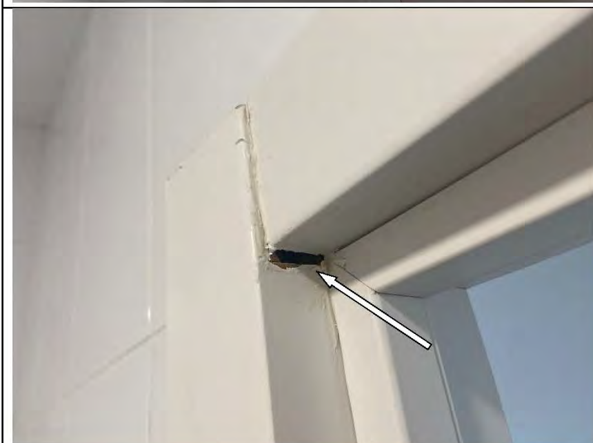
Фото №113. Дефект на наличниках деревянного дверного блока в ванной комнате.
