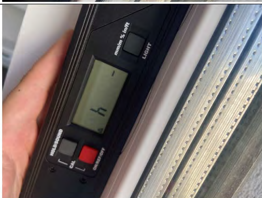
Фото №90. Отклонения от вертикали оконного блока ПВХ в кухне.
