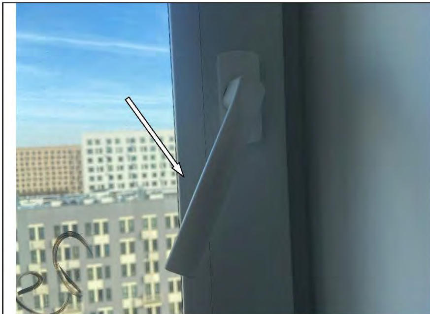
Фото №46. Не отрегулирована фурнитура оконного блока ПВХ в спальне.
