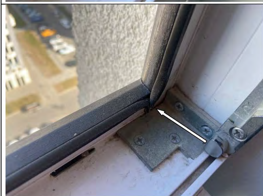
Фото №93. Дефект на уплотнительной ленте оконного блока ПВХ в кухне.
