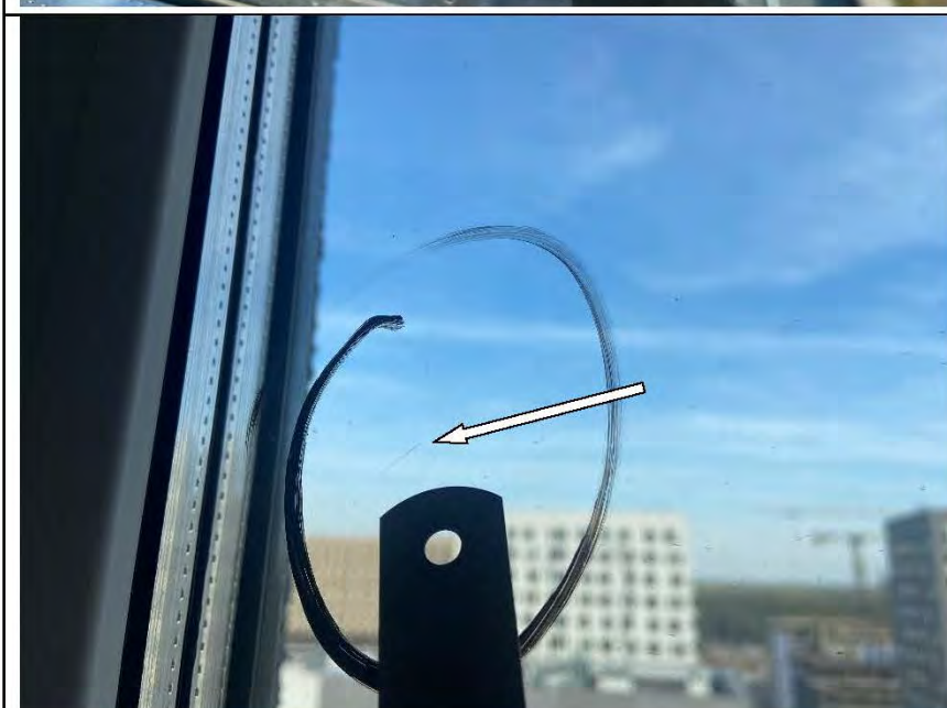
Фото №72. Царапина на стеклопакете оконного блока ПВХ в спальне.
