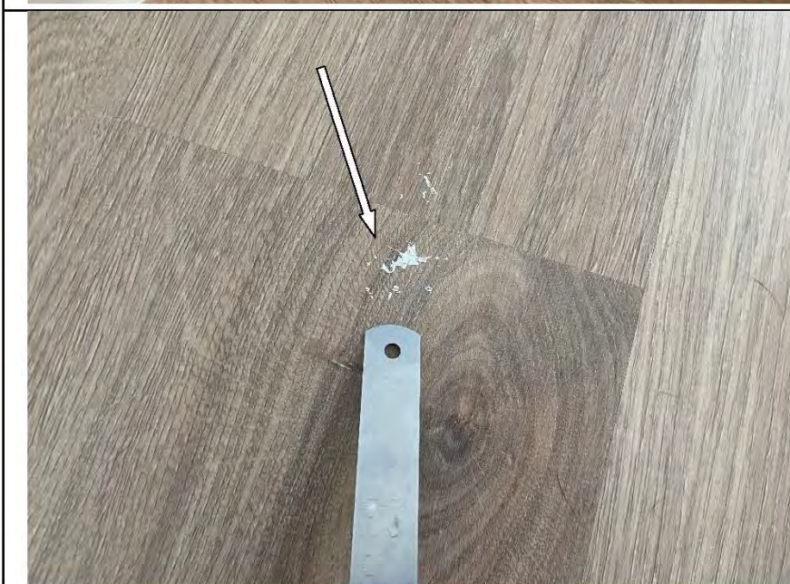
Фото №33. Дефект на напольном покрытии из ламината в коридоре.
