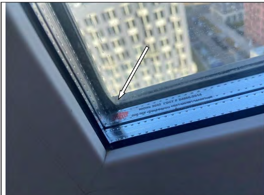
Фото №94. Дефект на уплотнительной ленте оконного блока ПВХ в кухне.
