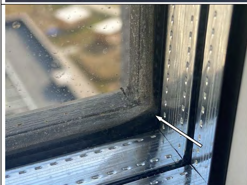
Фото №95. Дефект на уплотнительной ленте оконного блока ПВХ в кабинете.
