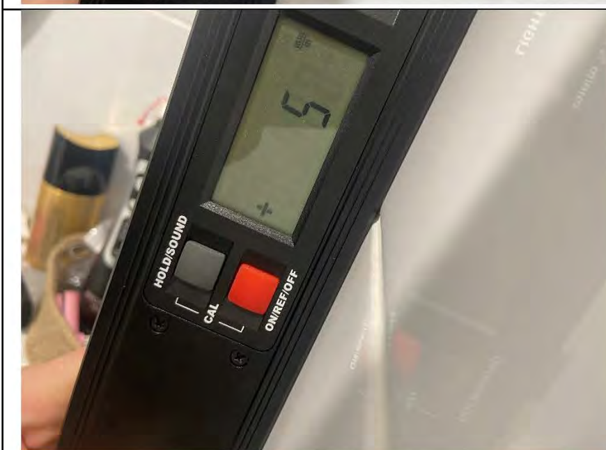
Фото №12. Отклонение поверхности стен от вертикали в ванной комнате.
