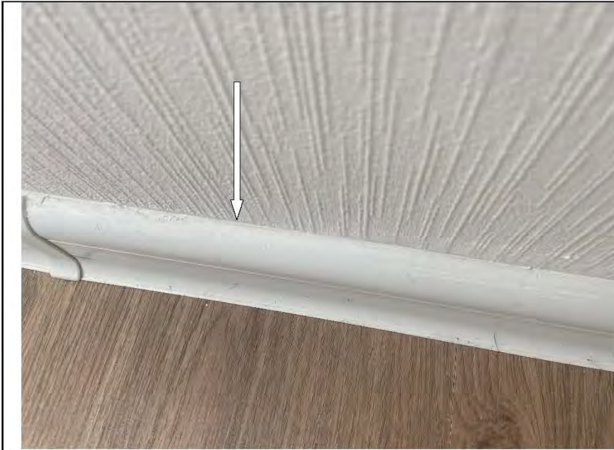
Фото №31. Дефект на напольном плинтусе ПВХ в кабинете.
