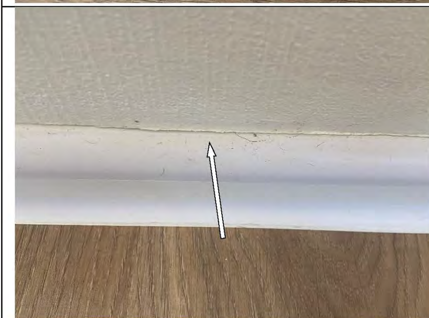
Фото №30. Дефект на напольном плинтусе ПВХ в кухне.
