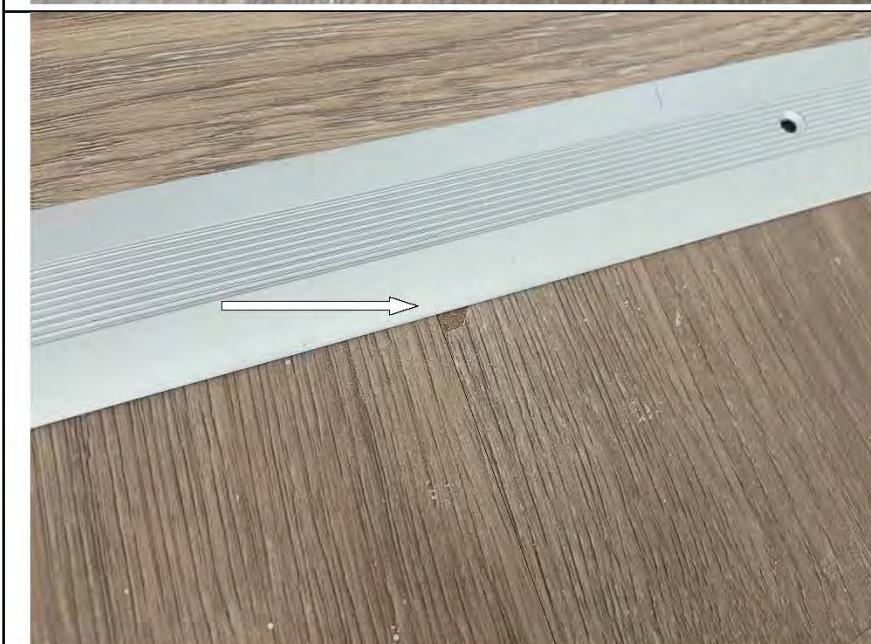
Фото №36. Дефект на напольном покрытии из ламината в кабинете.
