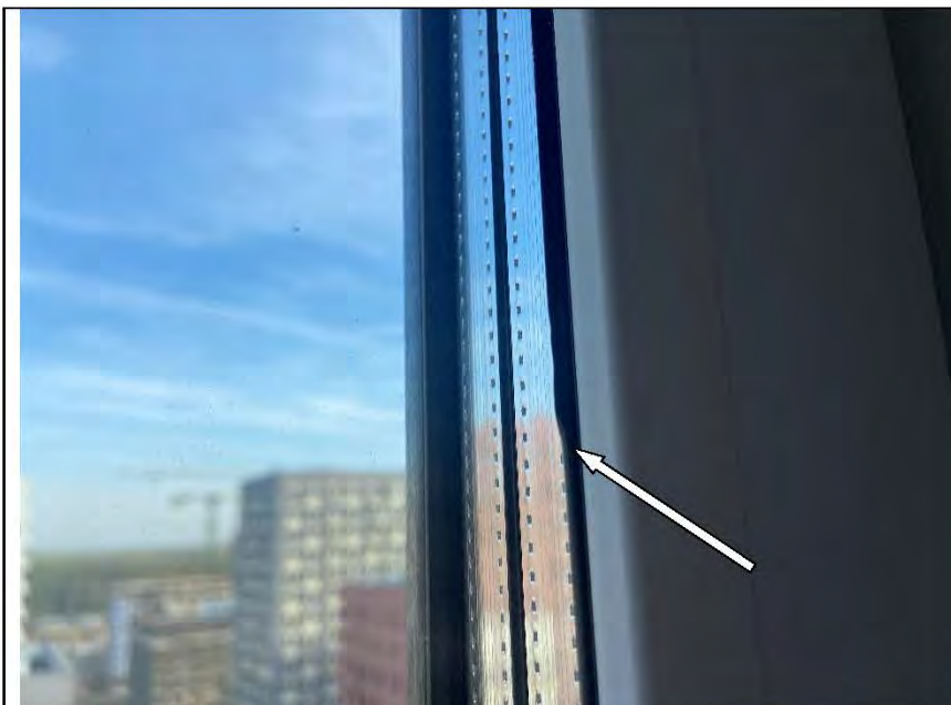
Фото №97. Дефект на уплотнительной ленте оконного блока ПВХ в спальне.
