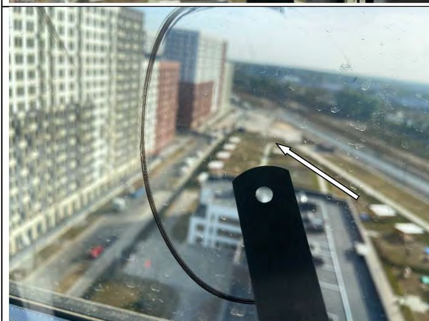
Фото №71. Царапина на стеклопакете оконного блока ПВХ в кабинете.
