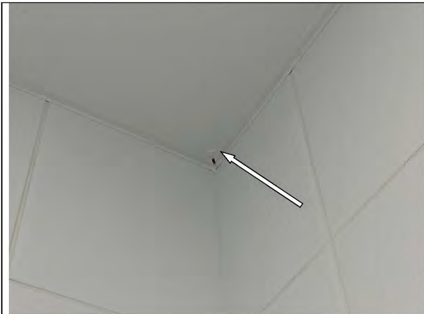
Фото №124. Дефект на поверхности натяжного потолка в ванной комнате.
