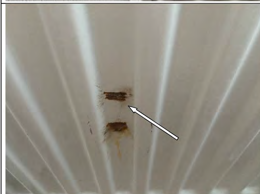
Фото №131. Дефект на поверхности металлического кожуха отопительного прибора в спальне.
