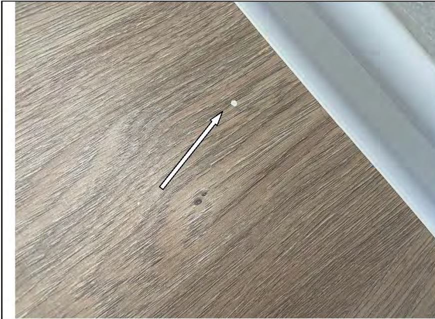
Фото №34. Дефект на напольном покрытии из ламината в кухне.
