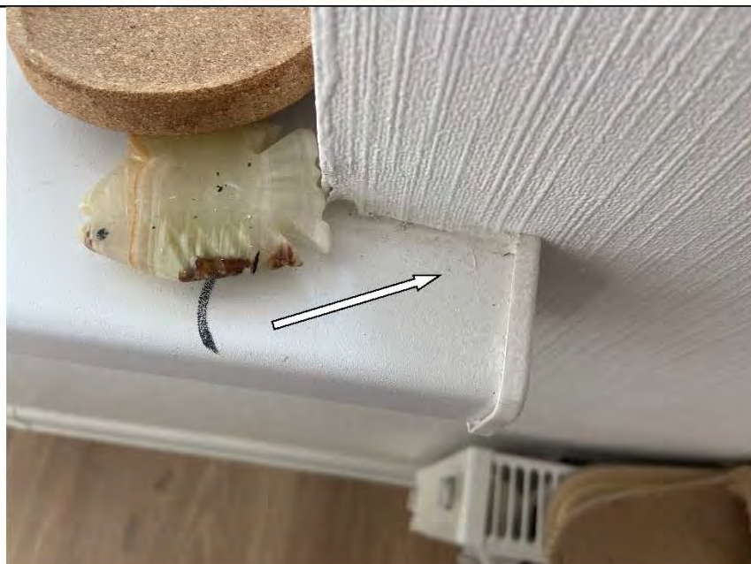
Фото №53. Царапина на лицевой стороне подоконной доски в кабинете.
