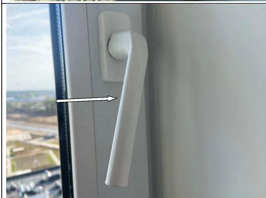
Фото №47. Не отрегулирована фурнитура оконного блока ПВХ в спальне.
