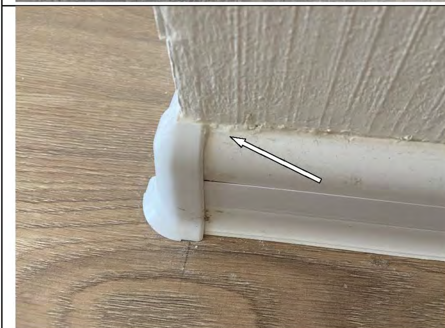
Фото №29. Дефект на напольном плинтусе ПВХ в коридоре.
