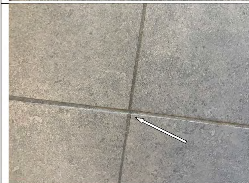
Фото №27. Неровные швы напольной керамической плитки в санузле.
