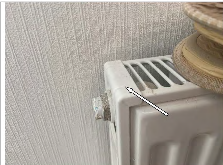
Фото №130. Дефект на поверхности металлического кожуха отопительного прибора в кабинете.
