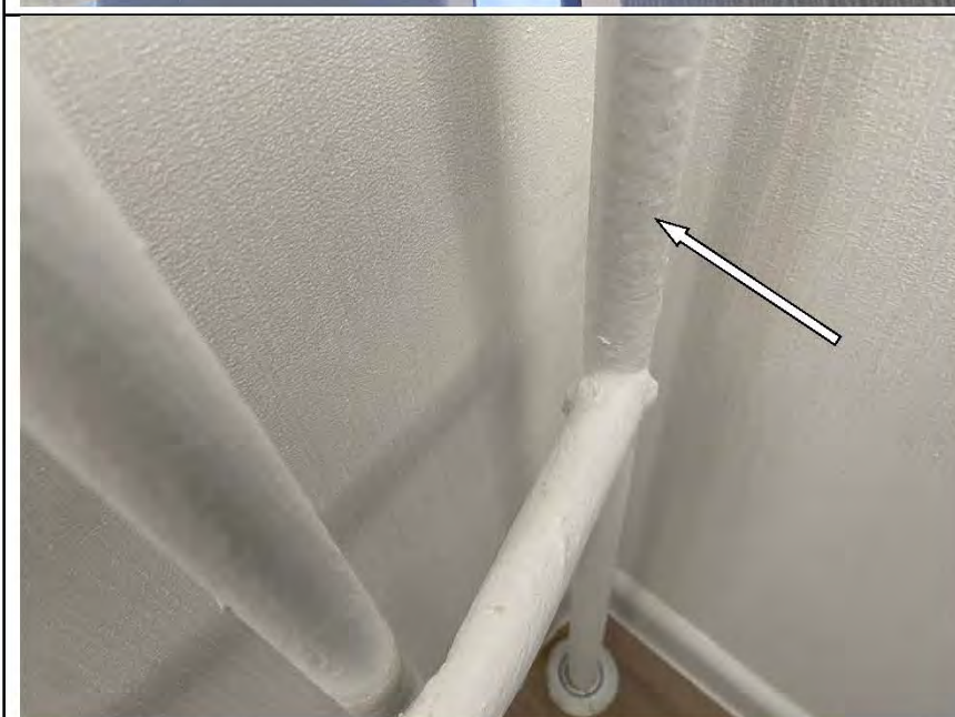
Фото №102. Неровности, подтеки на окрашенных трубах отопления в кухне.
