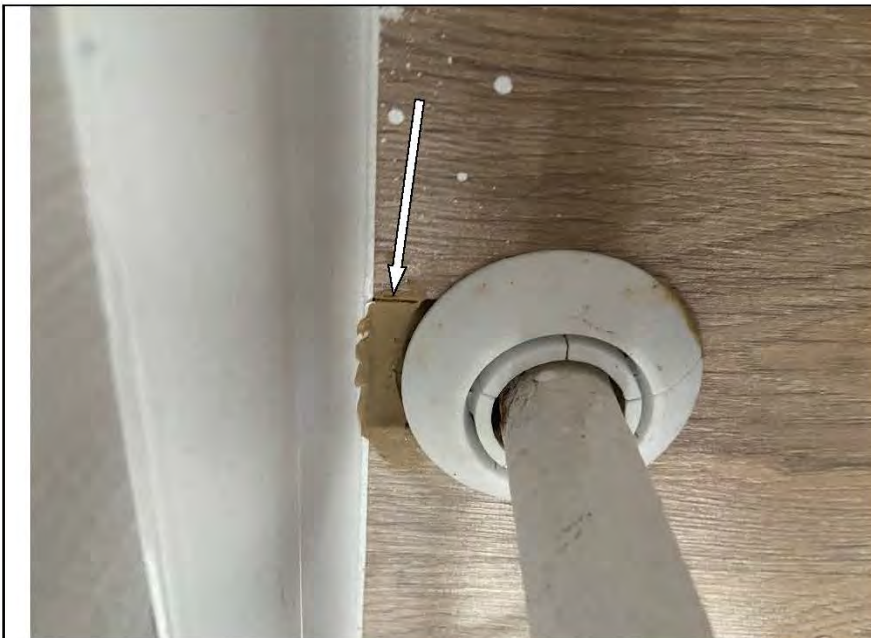
Фото №43. Дефект вставки труб отопления в напольное покрытие из ламината в кухне.
