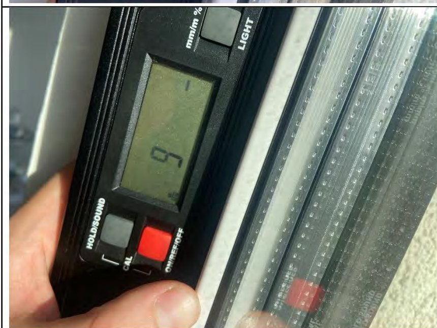
Фото №87. Отклонения от вертикали оконного блока ПВХ в кабинете.
