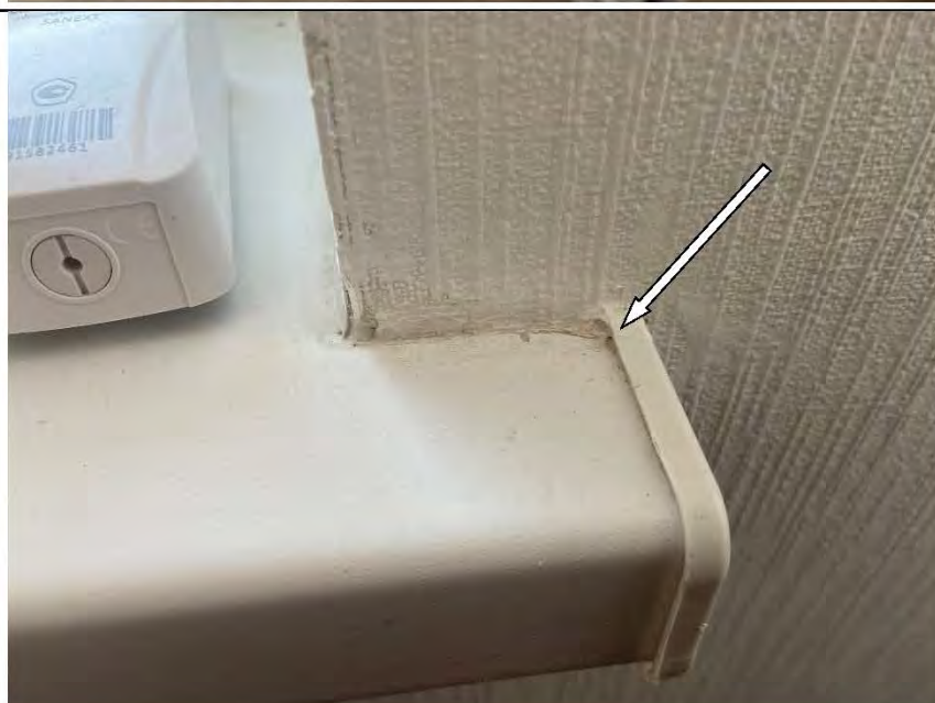
Фото №54. Царапина на лицевой стороне подоконной доски в спальне.
