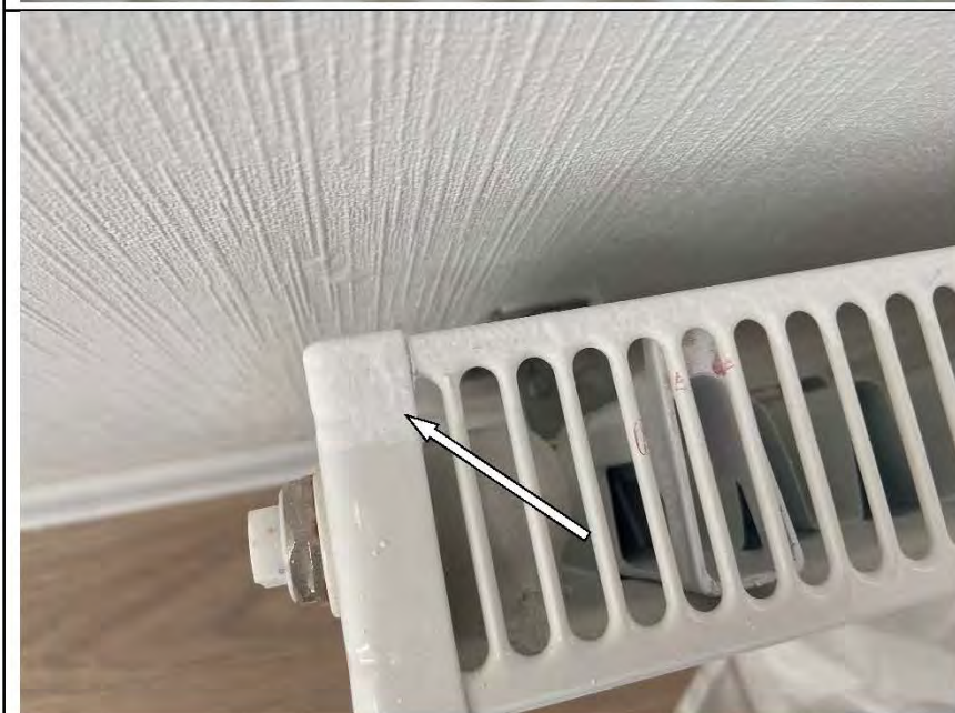
Фото №132. Дефект на поверхности металлического кожуха отопительного прибора в спальне.
