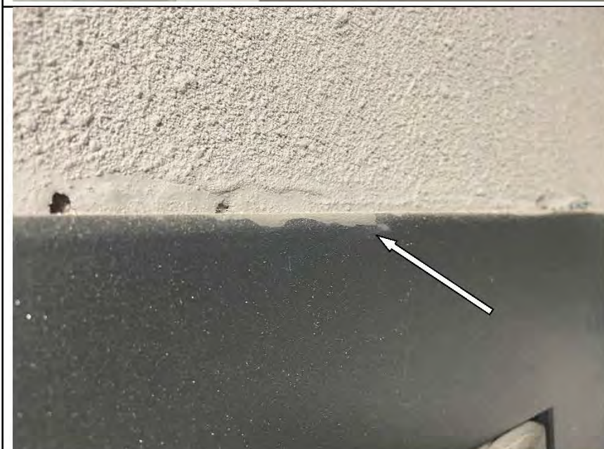
Фото №111. Дефект на наличниках входного дверного блока в коридоре.
