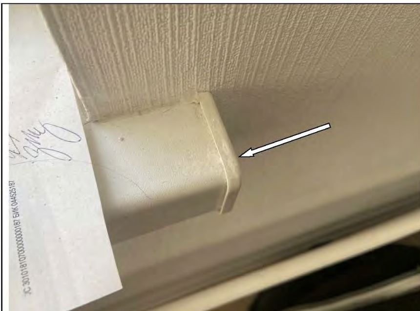
Фото №52. Царапина на лицевой стороне подоконной доски в кабинете.
