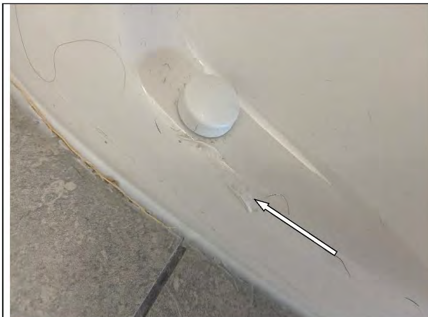
Фото №133. Загрязнения на унитазе в санузле.
