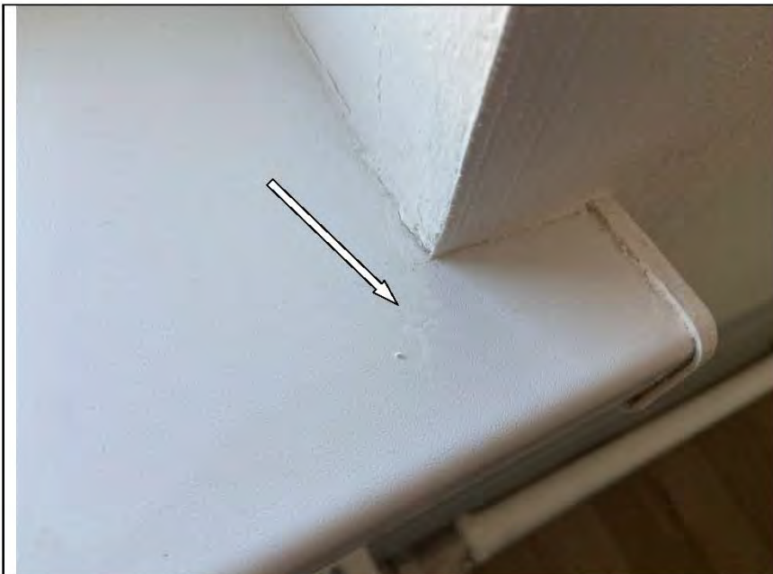
Фото №49. Царапина на лицевой стороне подоконной доски в кухне.
