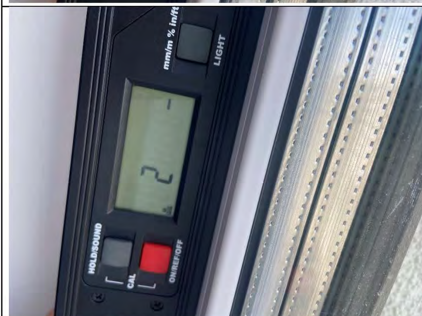
Фото №86. Отклонения от вертикали оконного блока ПВХ в спальне.
