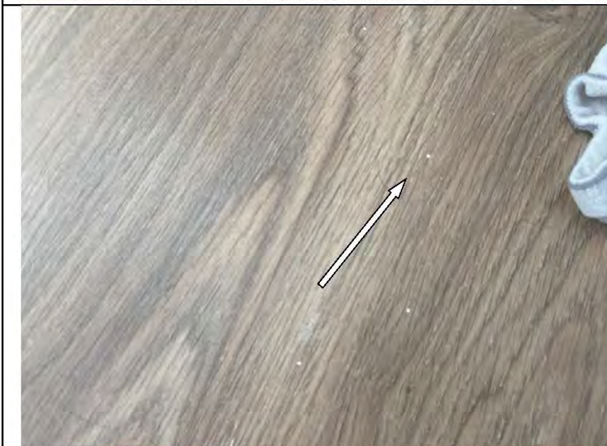
Фото №35. Дефект на напольном покрытии из ламината в кабинете.
