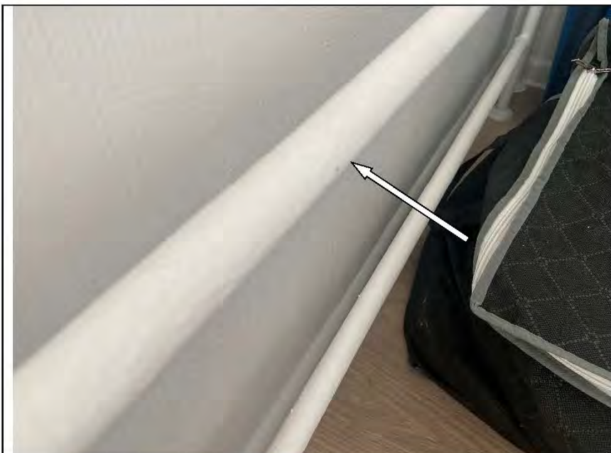
Фото №103. Неровности, подтеки на окрашенных трубах отопления в кабинете.
