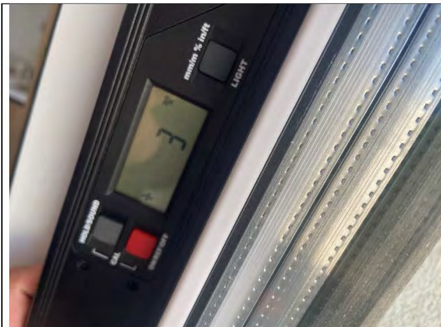
Фото №91. Отклонения от вертикали оконного блока ПВХ в кухне.
