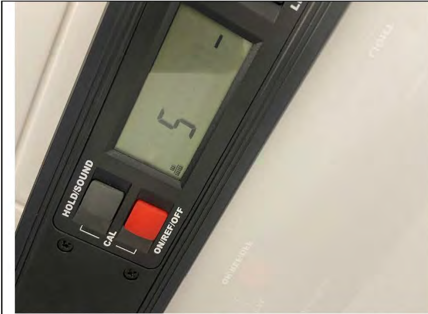
Фото №13. Отклонение поверхности стен от вертикали в санузле.
