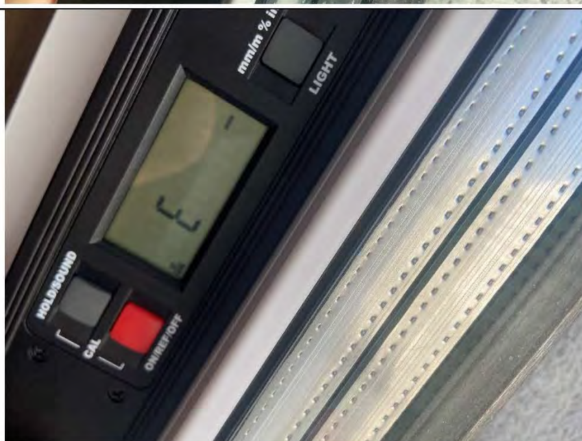
Фото №89. Отклонения от вертикали оконного блока ПВХ в кухне.
