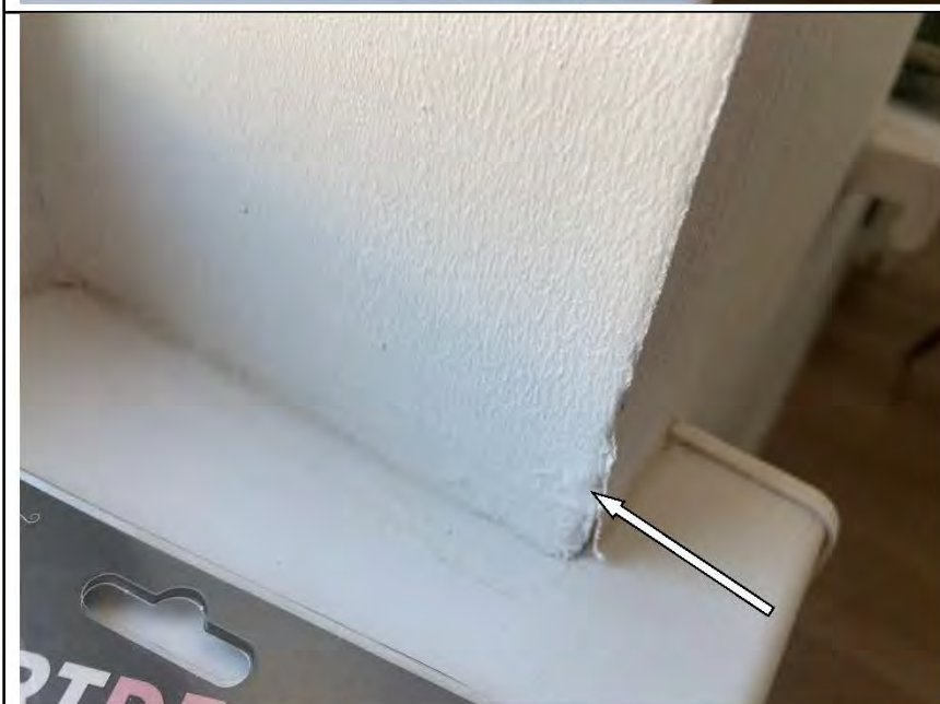
Фото №77. Неровности, выбоины, раковины на окрашенных откосах оконного блока ПВХ в кухне.
