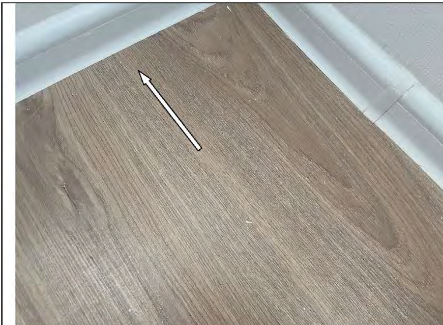
Фото №37. Дефект на напольном покрытии из ламината в спальне.
