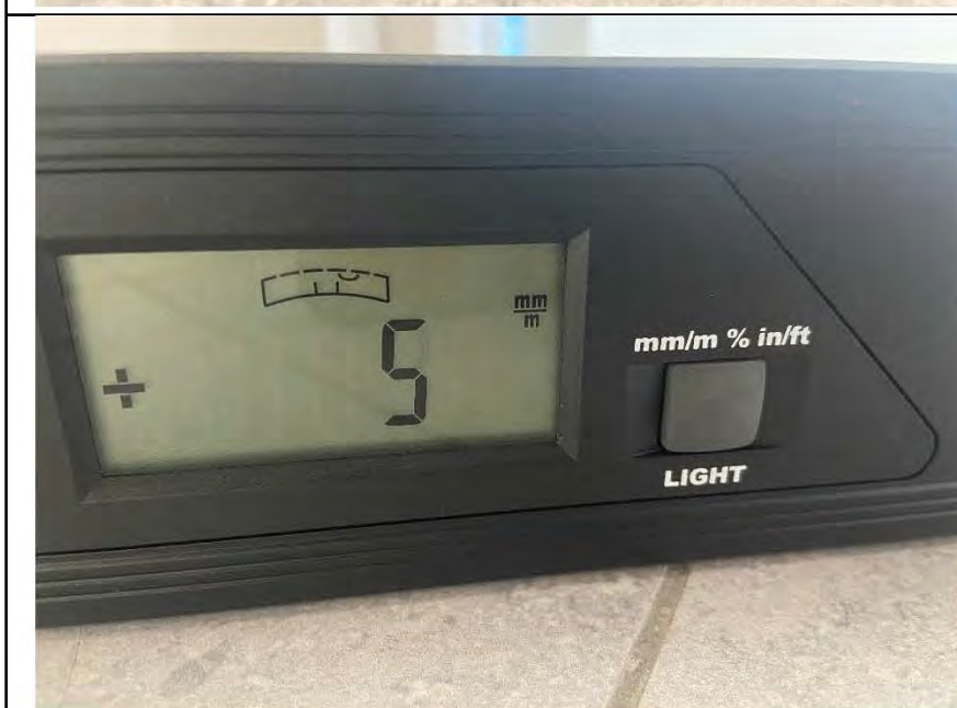
Фото №24. Отклонение поверхности напольного покрытия из керамической плитки в санузле.
