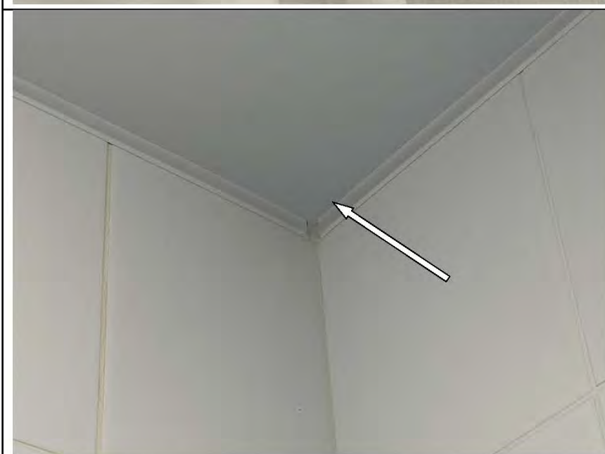
Фото №123. Дефект на поверхности натяжного потолка в санузле.
