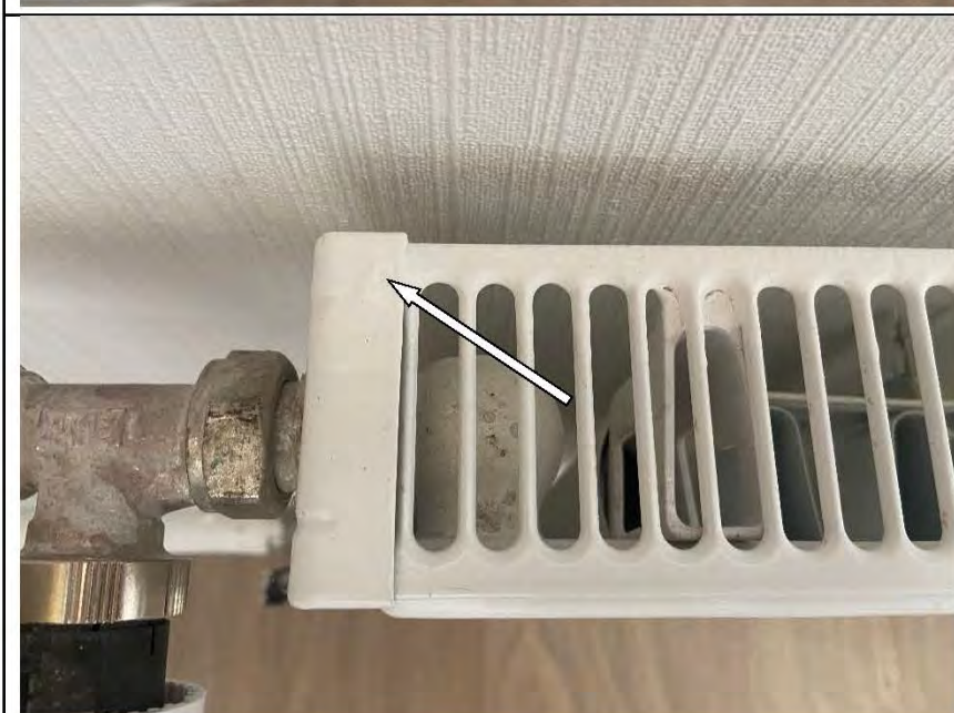
Фото №129. Дефект на поверхности металлического кожуха отопительного прибора в кухне.
