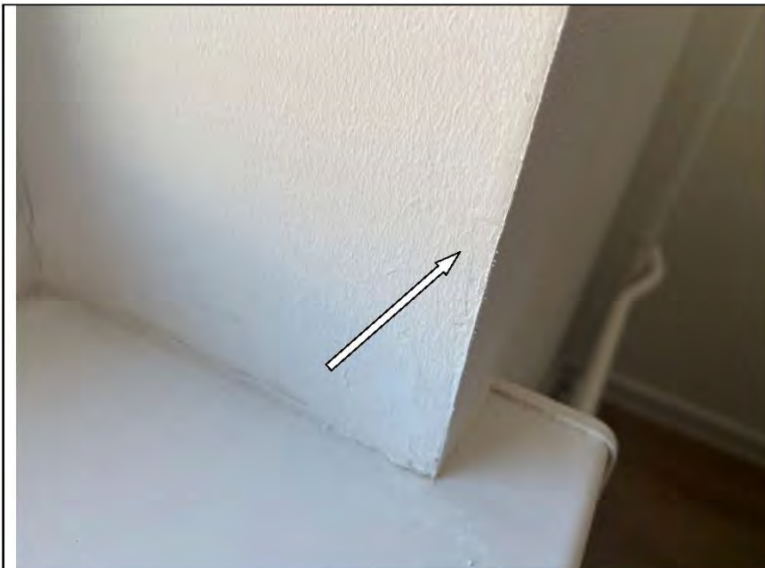
Фото №76. Неровности, выбоины, раковины на окрашенных откосах оконного блока ПВХ в кухне.
