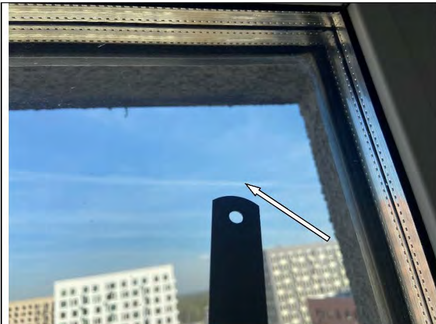
Фото №67. Царапина на стеклопакете оконного блока ПВХ в кухне.
