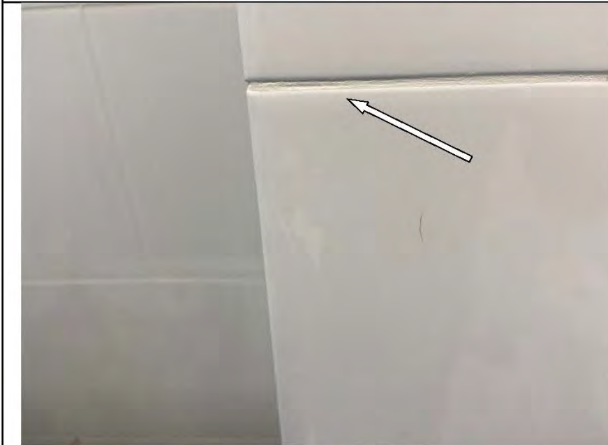
Фото №14. Загрязнения на настенной керамической плитке в санузле.
