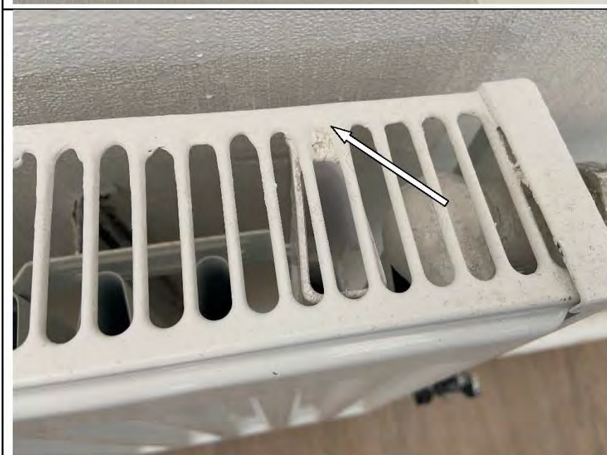
Фото №128. Дефект на поверхности металлического кожуха отопительного прибора в кухне.
