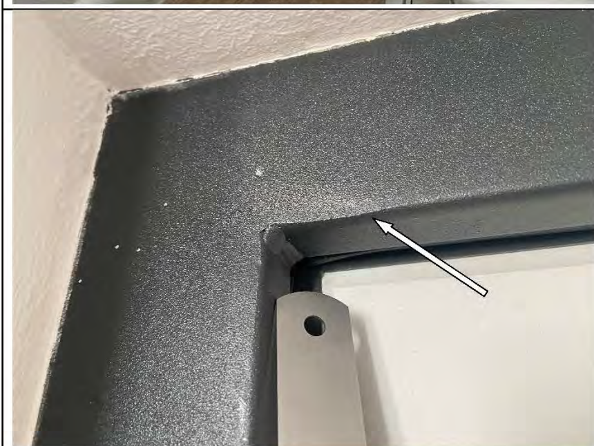
Фото №105. Дефекты на коробке входного дверного блока в коридоре.
