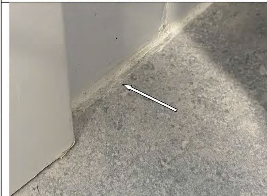
Фото №26. Загрязнения на напольной керамической плитке в ванной комнате.
