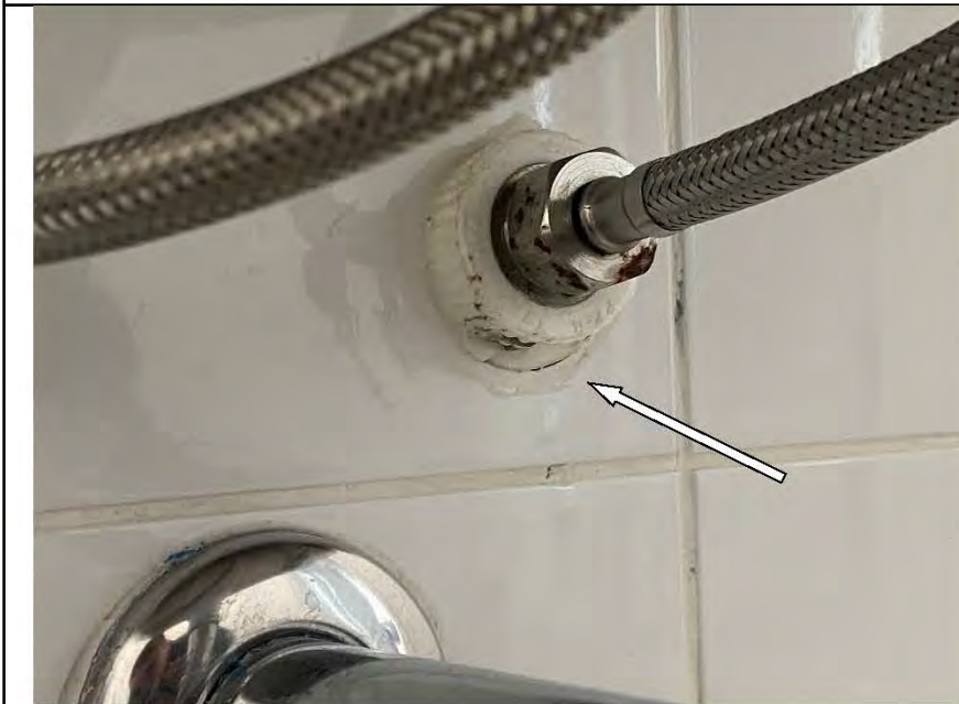
Фото №15. Загрязнения на настенной керамической плитке в ванной комнате.
