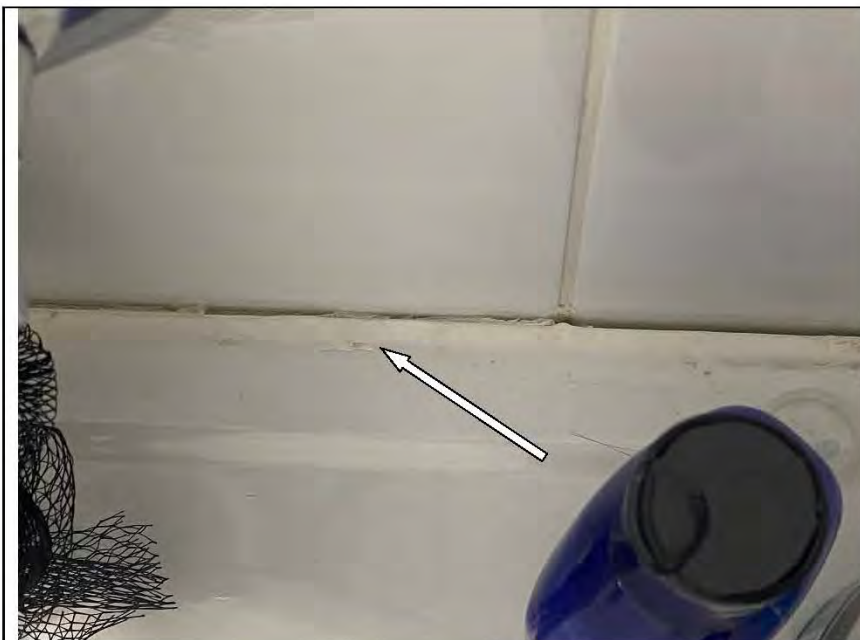
Фото №136. Загрязнения на ванне в ванной комнате.
