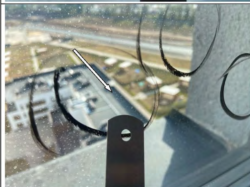
Фото №74. Царапина на стеклопакете оконного блока ПВХ в спальне.
