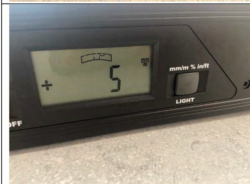
Фото №23. Отклонение поверхности напольного покрытия из керамической плитки в ванной комнате.
