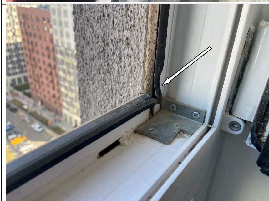
Фото №92. Дефект на уплотнительной ленте оконного блока ПВХ в кухне.
