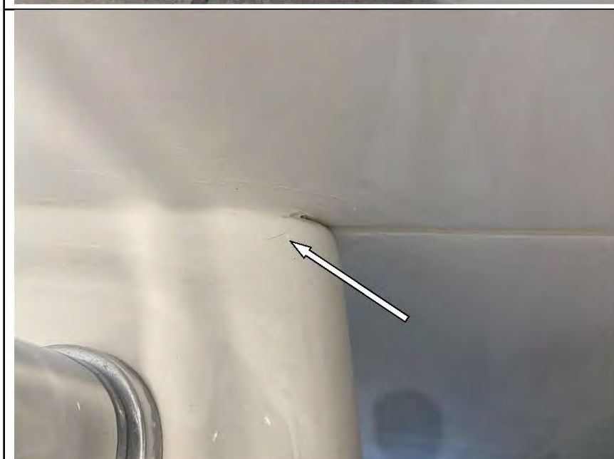
Фото №134. Загрязнения на раковине в санузле.
