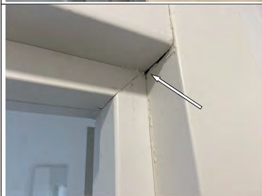
Фото №117. Дефект на коробке деревянного дверного блока в ванной комнате.
