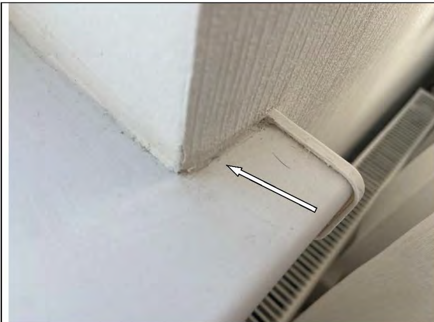
Фото №55. Царапина на лицевой стороне подоконной доски в спальне.
