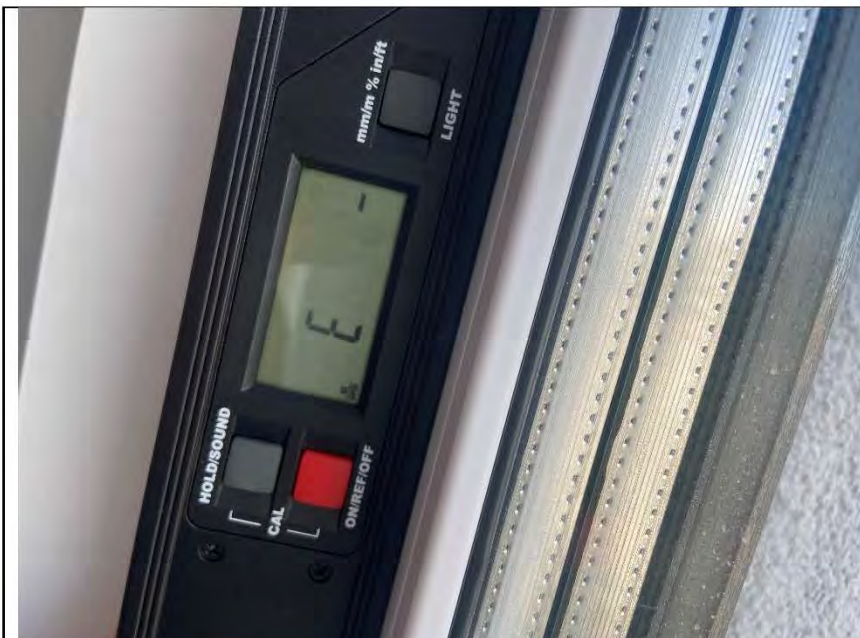
Фото №85. Отклонения от вертикали оконного блока ПВХ в спальне.
