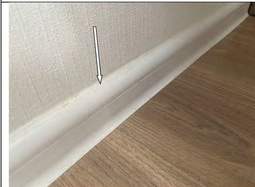
Фото №32. Дефект на напольном плинтусе ПВХ в спальне.
