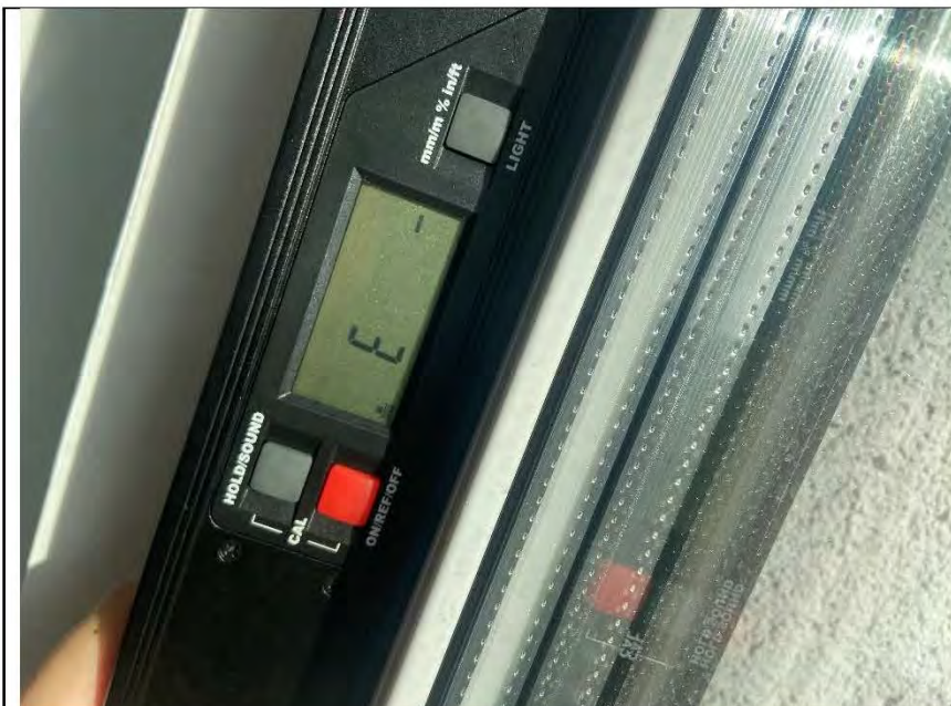
Фото №88. Отклонения от вертикали оконного блока ПВХ в кабинете.
