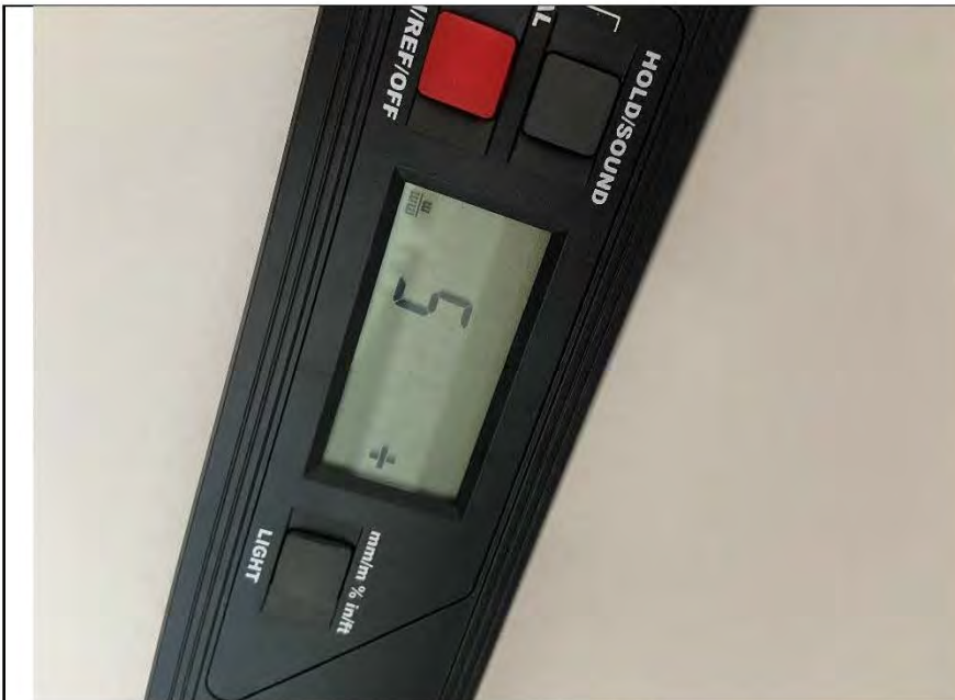
Фото №7. Отклонения поверхности стен от вертикали в коридоре.
