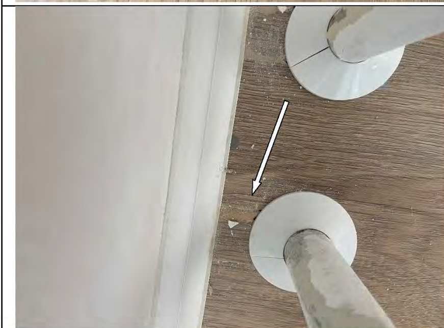
Фото №33. Дефект вставки труб отопления в напольное покрытие из ламината в кухне.
