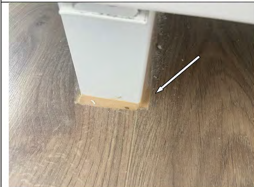
Фото №32. Дефект вставки крепления отопительного прибора в напольное покрытие из ламината в кухне.
