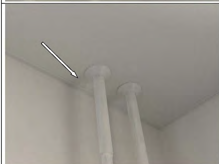
Фото №62. Загрязнения на поверхности натяжного потолка в кухне.
