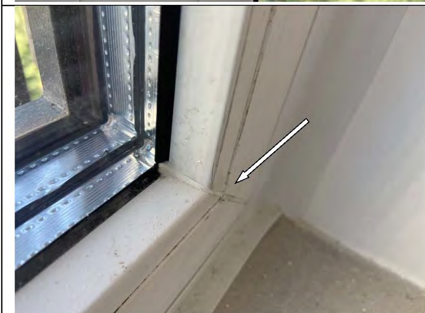
Фото №38. Дефект на профиле оконного блока ПВХ в кухне.
