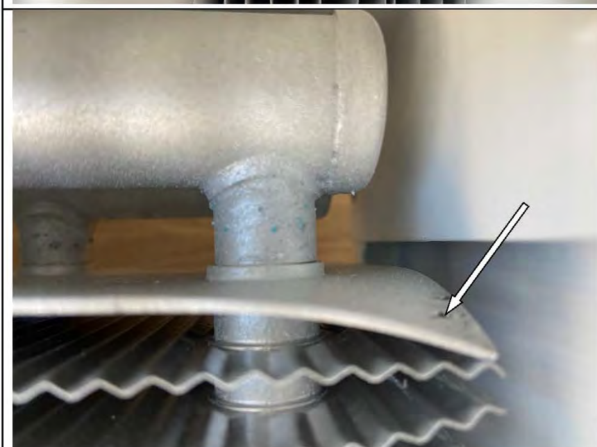
Фото №68. Загиб радиатора в кухне.
