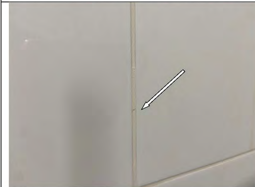
Фото №12. Неровные швы настенной керамической плитки в ванной комнате.
