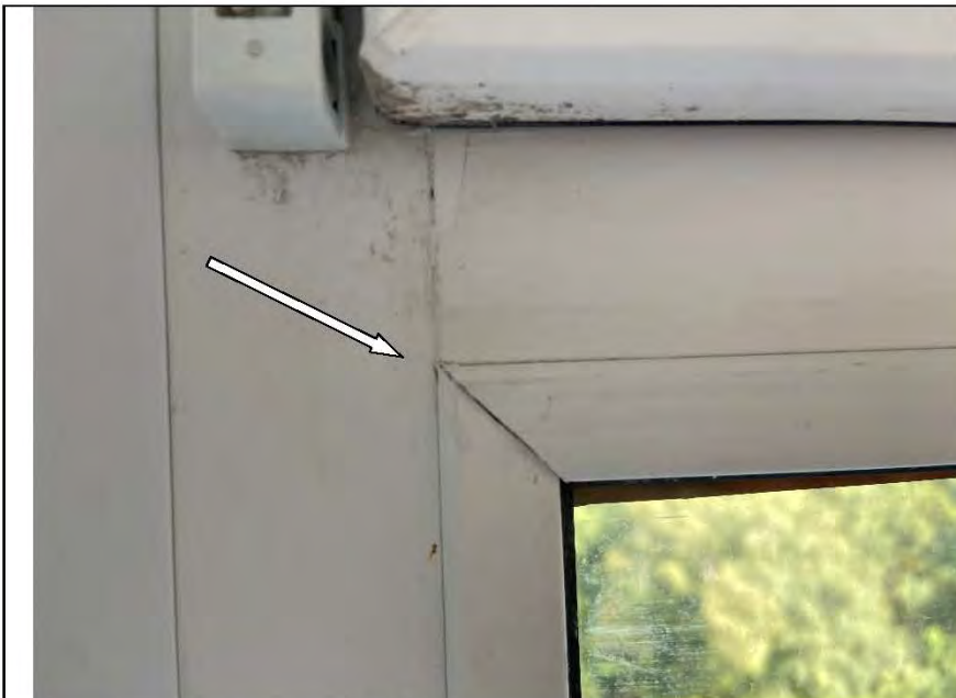
Фото №37. Дефект на профиле оконного блока ПВХ в спальне.
