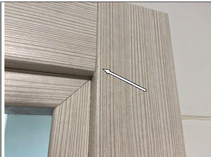
Фото №55. Дефект на наличниках деревянного дверного блока в ванной комнате.
