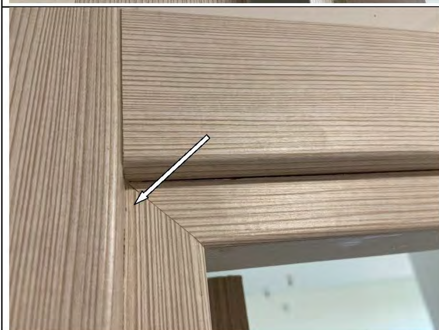
Фото №57. Дефект на коробке деревянного дверного блока в ванной комнате.
