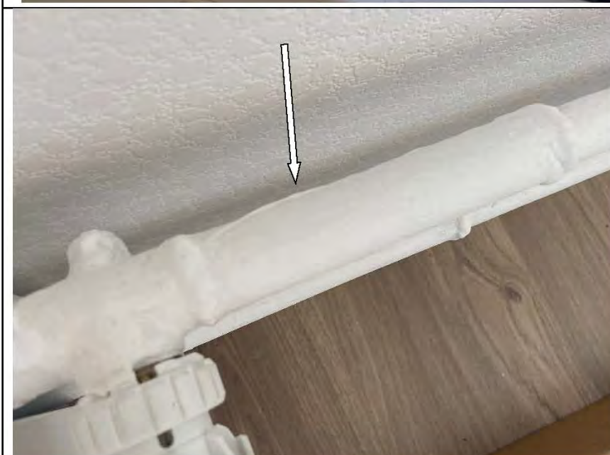
Фото №47. Неровности, подтеки на окрашенных трубах отопления в спальне.
