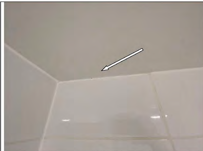
Фото №64. Загрязнения на поверхности подвесного потолка в ванной комнате.
