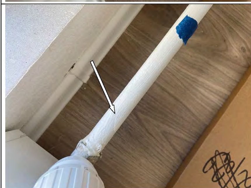
Фото №48. Неровности, подтеки на окрашенных трубах отопления в кухне.
