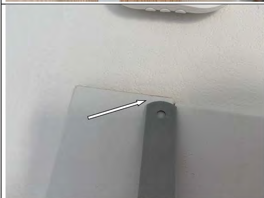
Фото №53. Дефект на наличниках входного дверного блока в коридоре.
