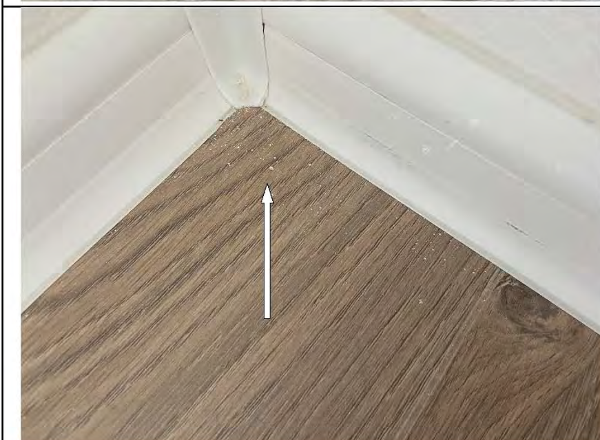
Фото №30. Дефект на напольном покрытии из ламината в кухне.
