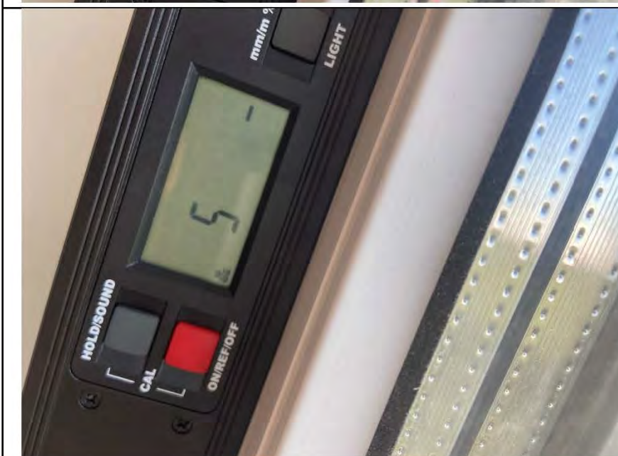
Фото №44. Отклонение по вертикали оконного блока ПВХ в кухне.
