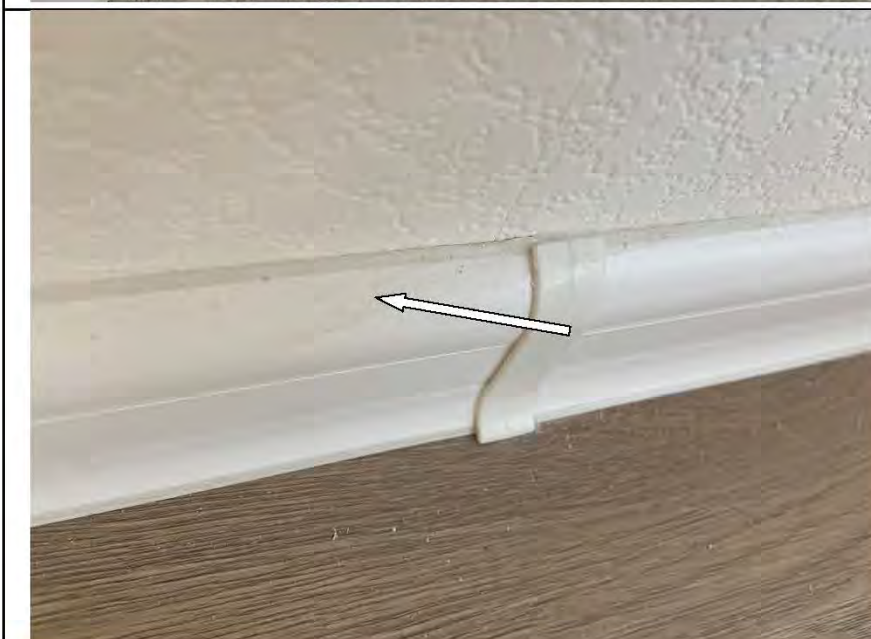
Фото №27. Дефект на напольном плинтусе ПВХ в спальне.
