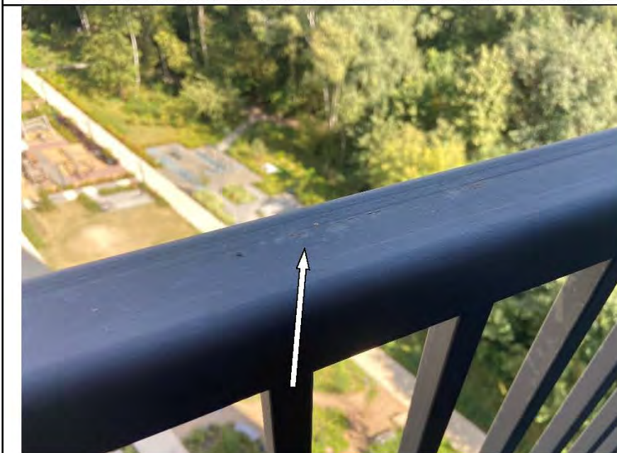
Фото №35. Коррозия на поверхности металлического ограждения на кухне.
