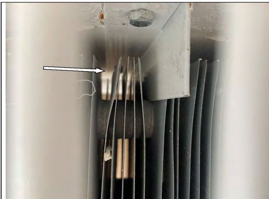
Фото №67. Загиб радиатора в спальне.
