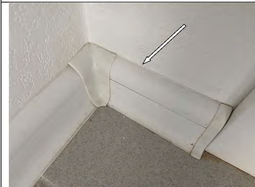
Фото №26. Дефект на напольном плинтусе ПВХ в коридоре.
