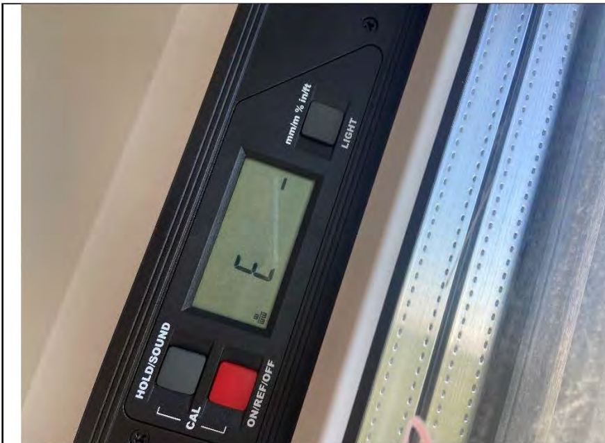
Фото №43. Отклонение по вертикали оконного блока ПВХ в спальне.
