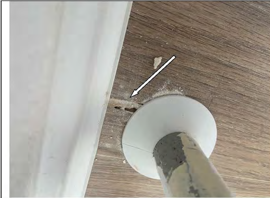
Фото №31. Дефект вставки труб отопления в напольное покрытие из ламината в спальне.
