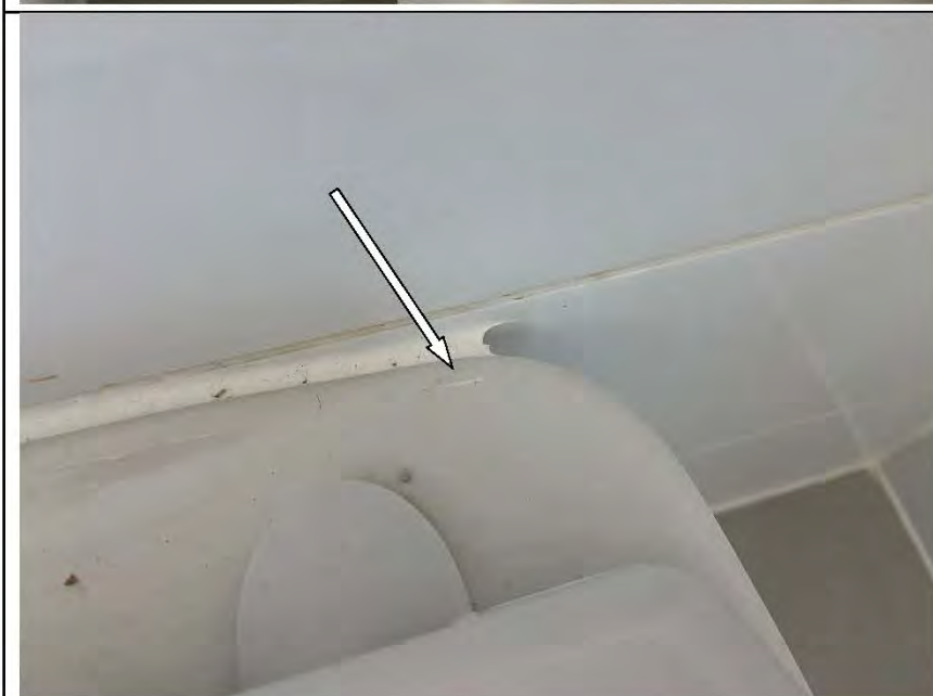
Фото № 71. Загрязнения на унитазе в ванной комнате.
