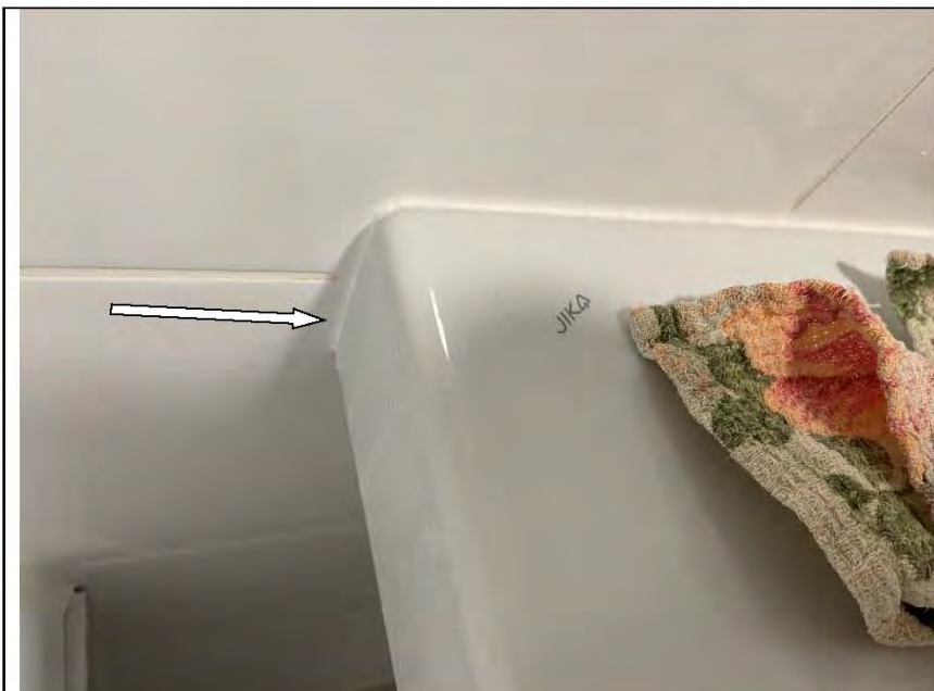
Фото №70. Загрязнения на раковине в ванной комнате.
