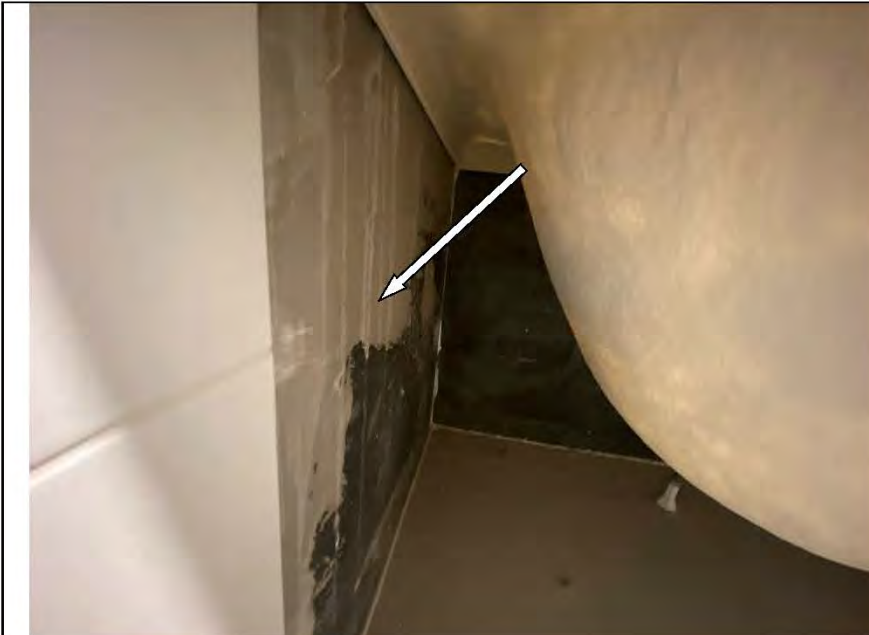
Фото №13. Частично отсутствует настенная керамическая плитка в ванной комнате.
