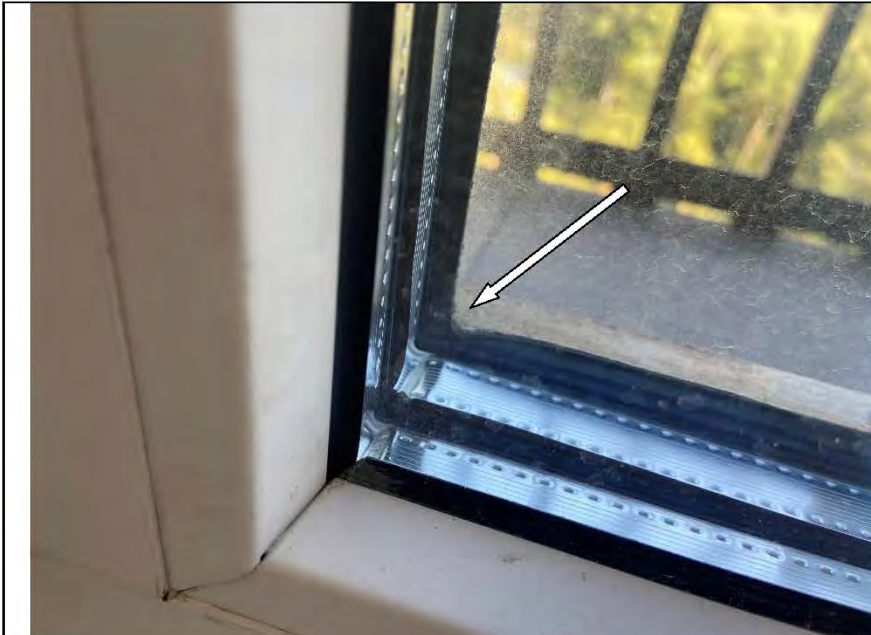
Фото №46. Дефект на уплотнительной ленте оконного блока ПВХ в кухне.
