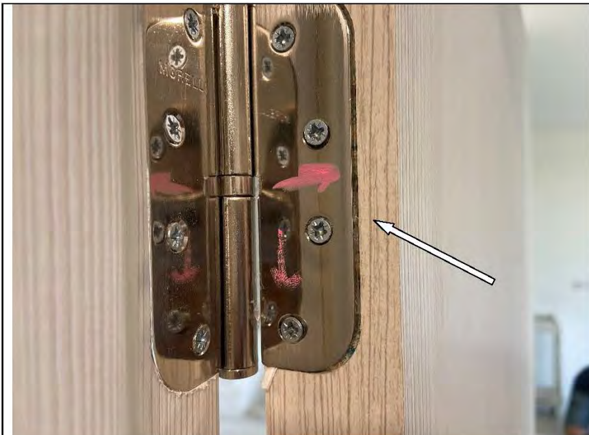
Фото №52. Дефект на полотне деревянного дверного блока в ванной комнате.
