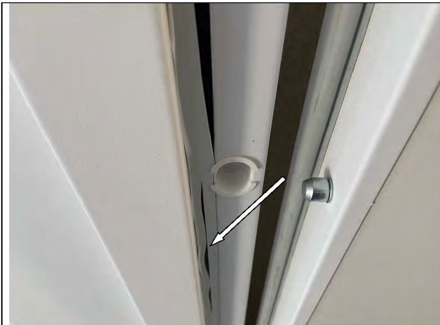
Фото №58. Дефект на уплотнительной противопожарной ленте входного дверного блока в коридоре.
