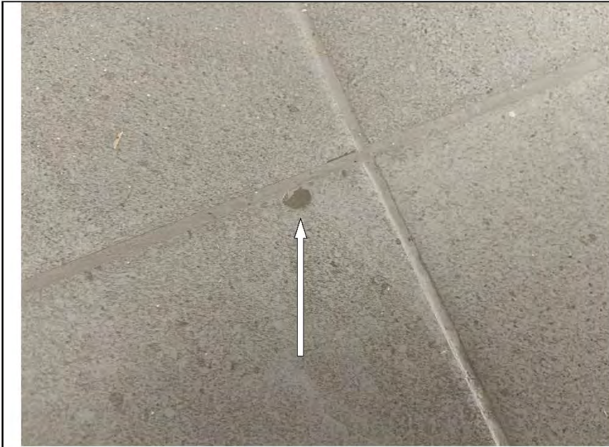
Фото №22. Скол на напольной керамической плитке в кухне.
