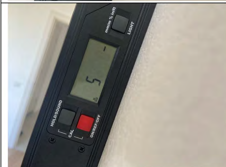
Фото №8. Отклонения поверхности стен от вертикали в кухне.
