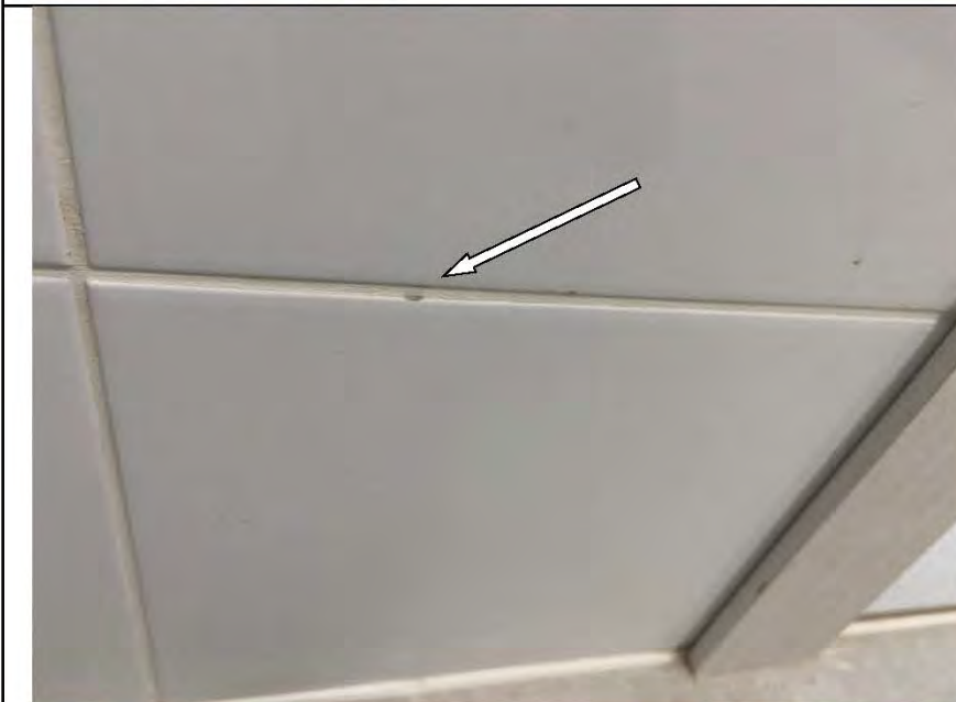
Фото №14. Сколы, отбитости на настенной керамической плитке в ванной комнате.
