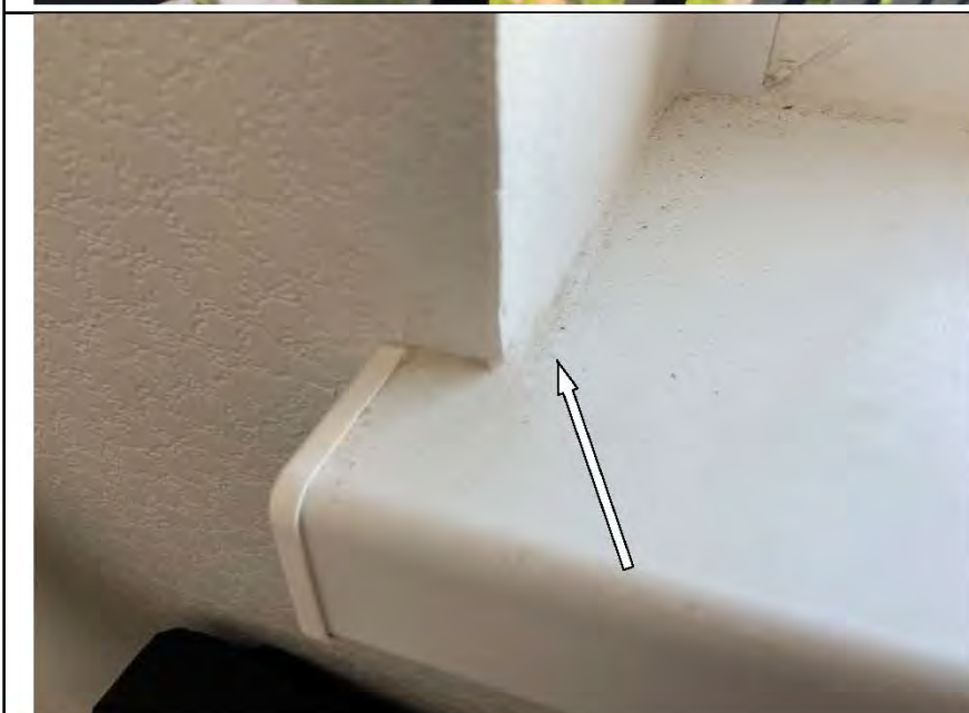
Фото №36. Царапина на лицевой стороне подоконной доски в спальне.
