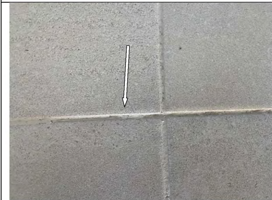
Фото №23. Неровные швы напольной керамической плитки в коридоре.
