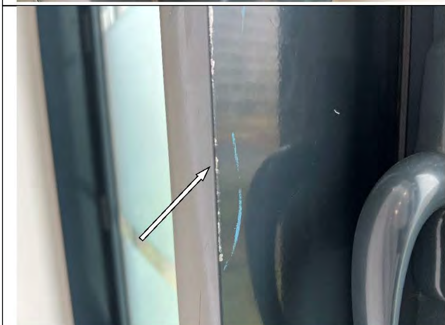
Фото №59. Царапина на металлическом профиле оконного блока в кухне.
