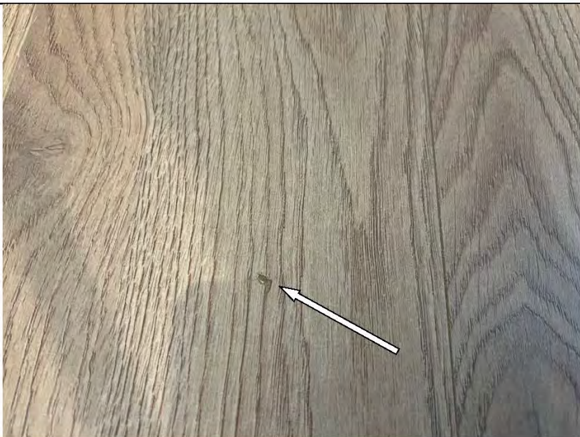
Фото №35. Вмятина на напольном покрытии из ламината в коридоре.
