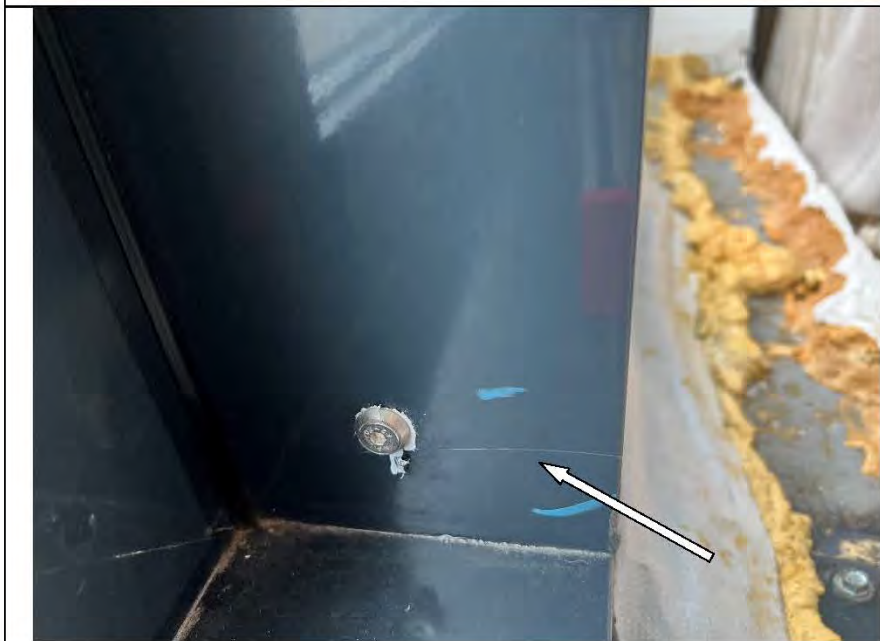
Фото №45. Царапина на металлическом профиле оконного блока в спальне.
