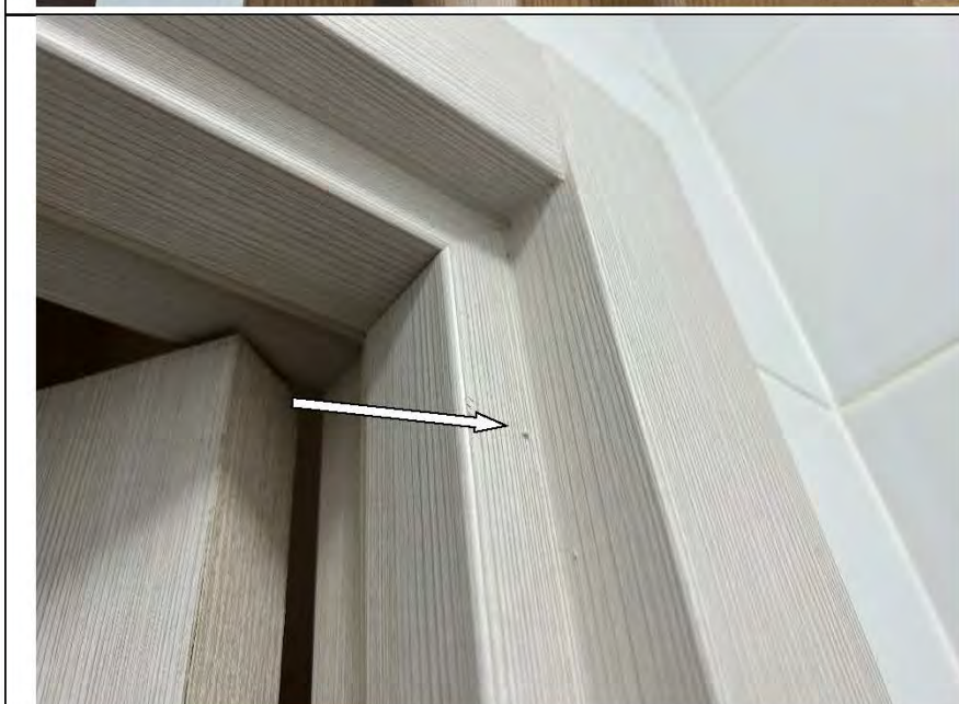
Фото №87. Скол на коробке деревянного дверного блока в санузле.
