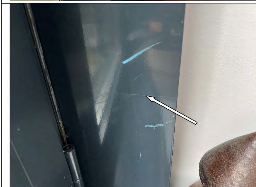
Фото №50. Царапина на металлическом профиле оконного блока в гостиной.
