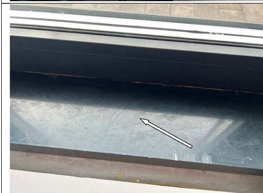
Фото №56. Царапина на металлическом профиле оконного блока в гостиной.
