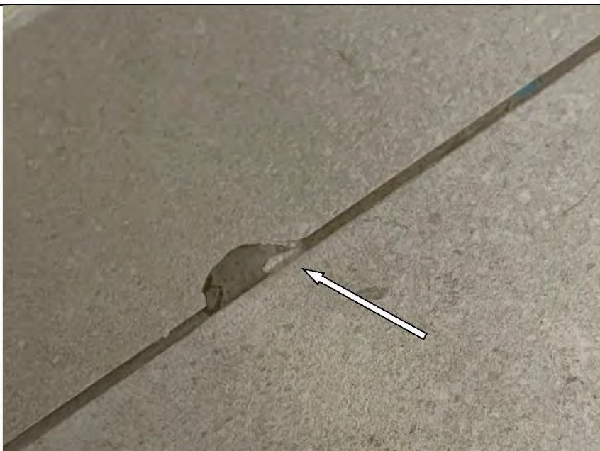
Фото №33. Отбитости напольной керамической плитки в ванной комнате.
