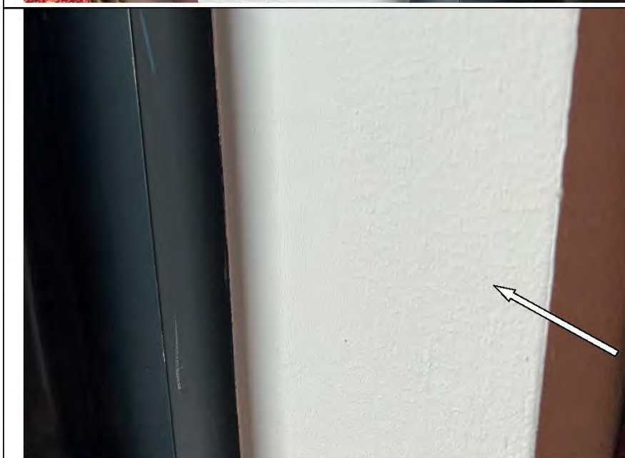
Фото №38. Подтеки краски на откосах оконного блока ПВХ в гостиной.
