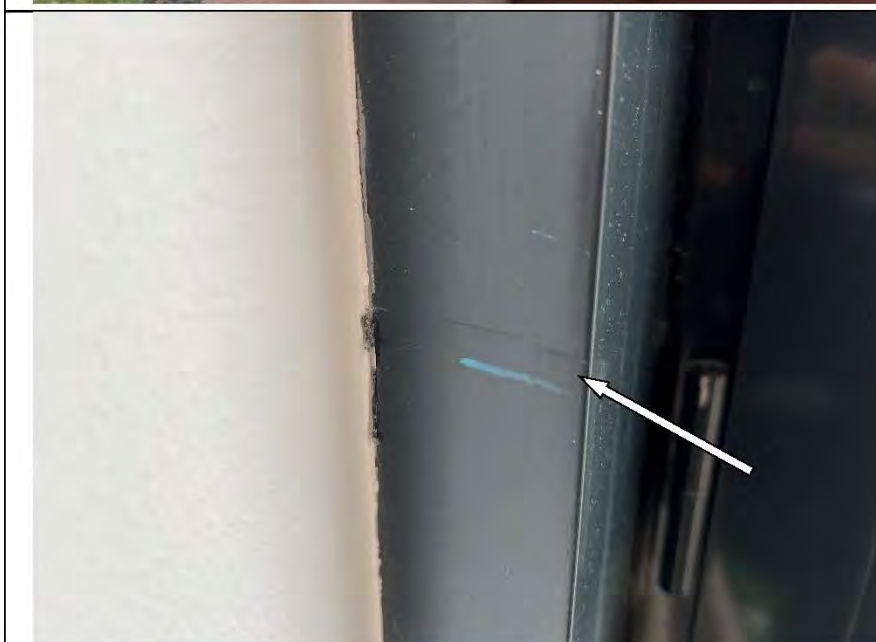
Фото №41. Царапина на металлическом профиле оконного блока в спальне.
