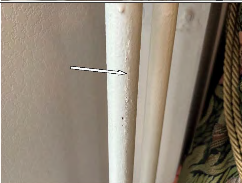
Фото №90. Подтеки краски на окрашенных трубах в гостиной.
