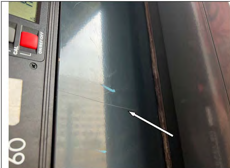
Фото №52. Царапина на металлическом профиле оконного блока в гостиной.
