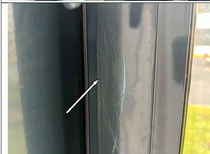
Фото №60. Царапина на металлическом профиле оконного блока в кухне.
