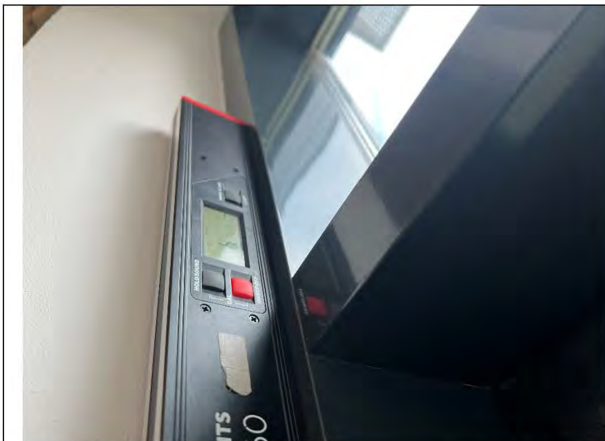
Фото №67. Отклонение металлического оконного блока в кухне по уровню вертикальности составляет 4 мм.
