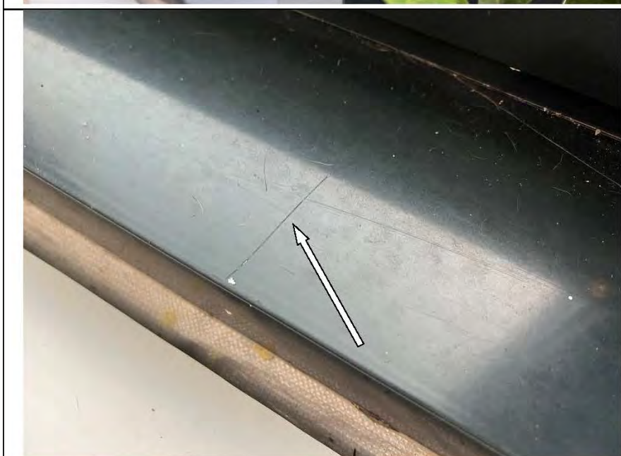
Фото №62. Царапина на металлическом профиле оконного блока в кухне.
