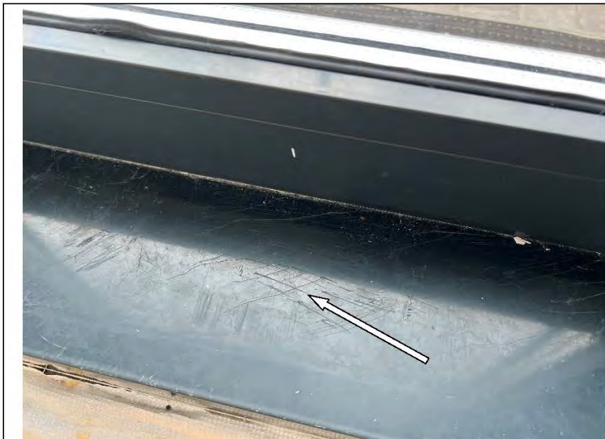
Фото №46. Царапина на металлическом профиле оконного блока в спальне.
