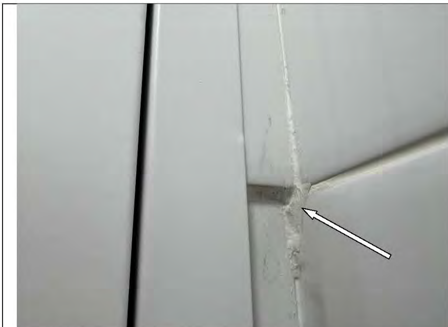
Фото №25. Зазоры в стыках настенной керамической плитки в санузле более 1 мм.
