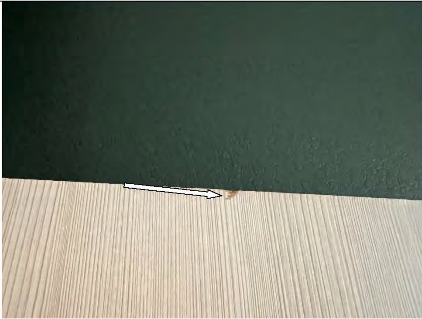
Фото №76. Скол на полотне дверного блока в кухне.
