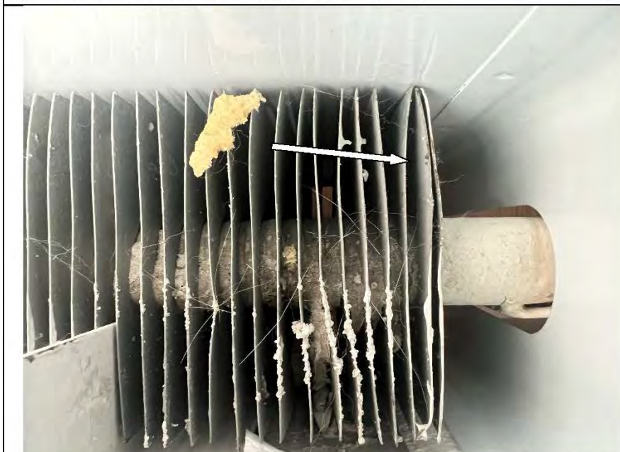
Фото №92. Замытие сот радиатора в спальне.
