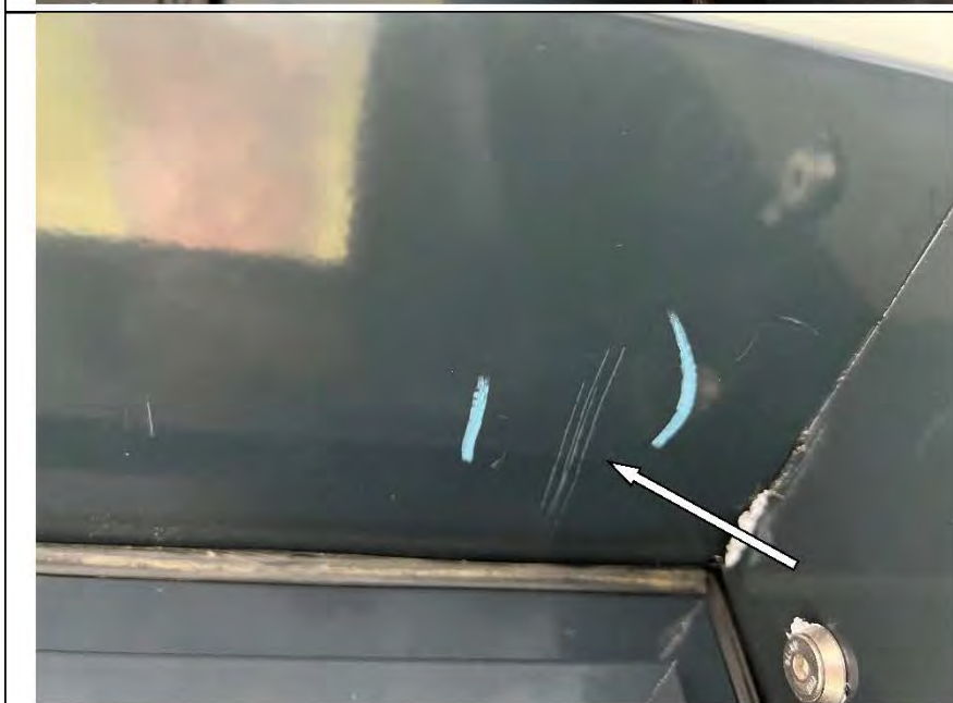
Фото №53. Царапина на металлическом профиле оконного блока в гостиной.
