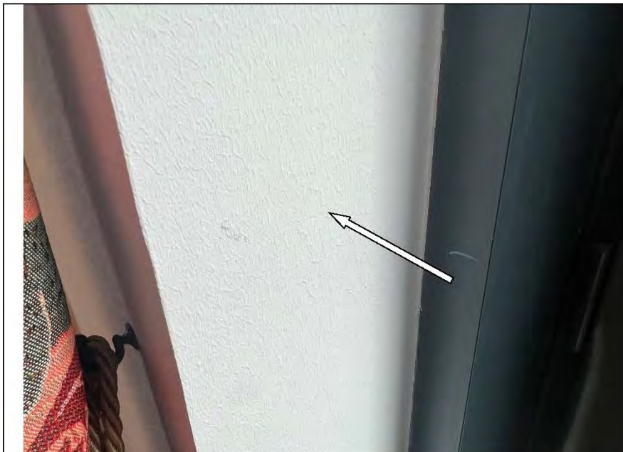
Фото №37. Подтеки краски на откосах оконного блока ПВХ в гостиной.
