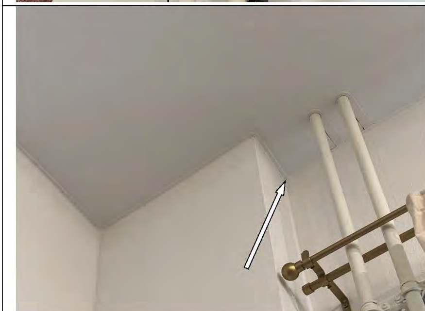
Фото №69. Зазор в стыке монтажа декоративного молдинга в кухне.
