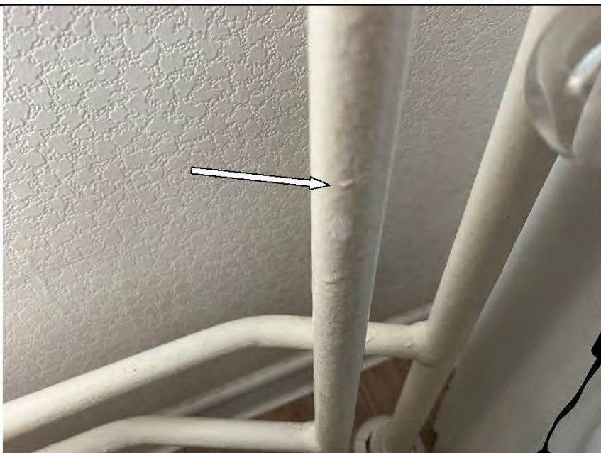
Фото №89. Подтеки краски на окрашенных трубах в спальне.
