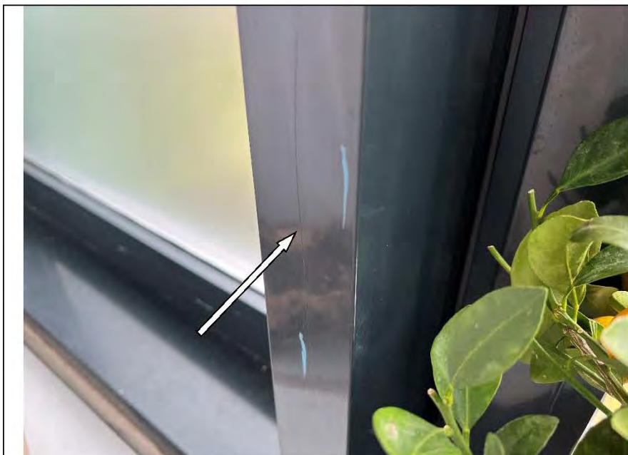
Фото №61. Царапина на металлическом профиле оконного блока в кухне.
