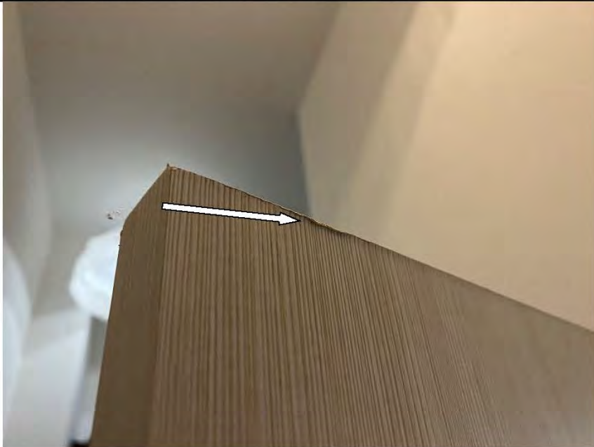
Фото №77. Отслоение ламинации на полотне дверного блока в ванной комнате.
