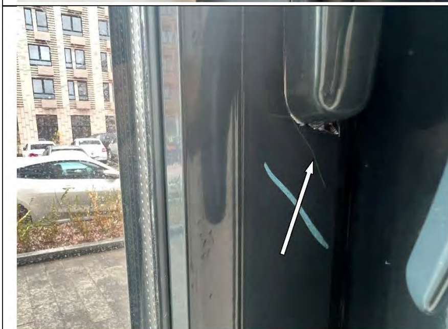
Фото №42. Царапина на металлическом профиле оконного блока в спальне.
