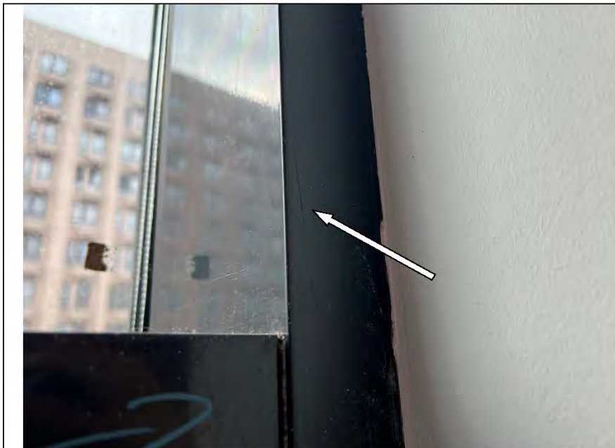
Фото №55. Царапина на металлическом профиле оконного блока в гостиной.
