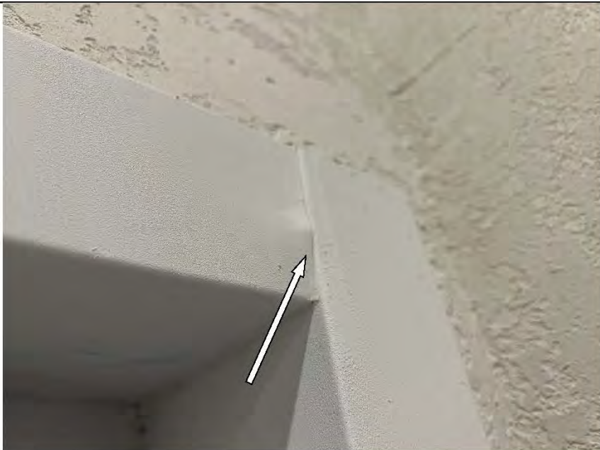
Фото №74. Вмятина на коробке входного дверного блока.
