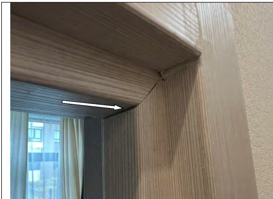
Фото №79. Элементы дверного блока соединены не надежно в кухне.
