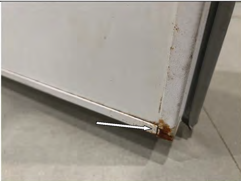
Фото №75. Коррозия на полотне входного дверного блока.
