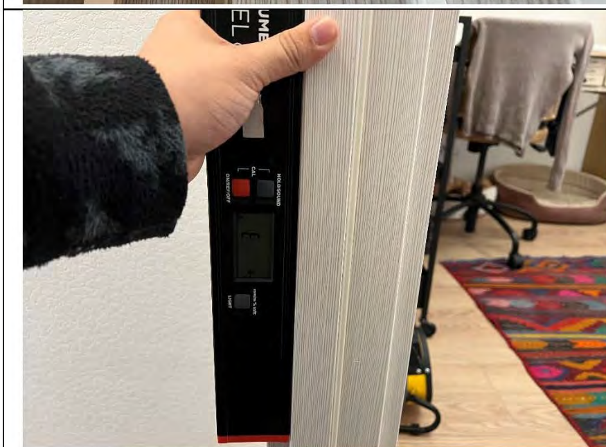
Фото №81. Отклонение коробки от плоскостности и прямолинейности дверного блока в спальне составляет 3 мм.
