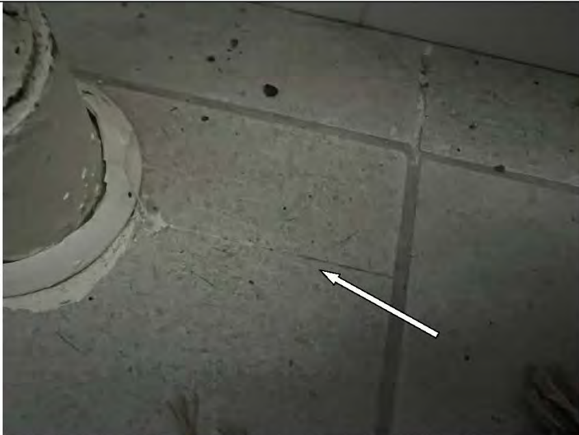
Фото №34. Механическое повреждение напольной керамической плитки в кухне.
