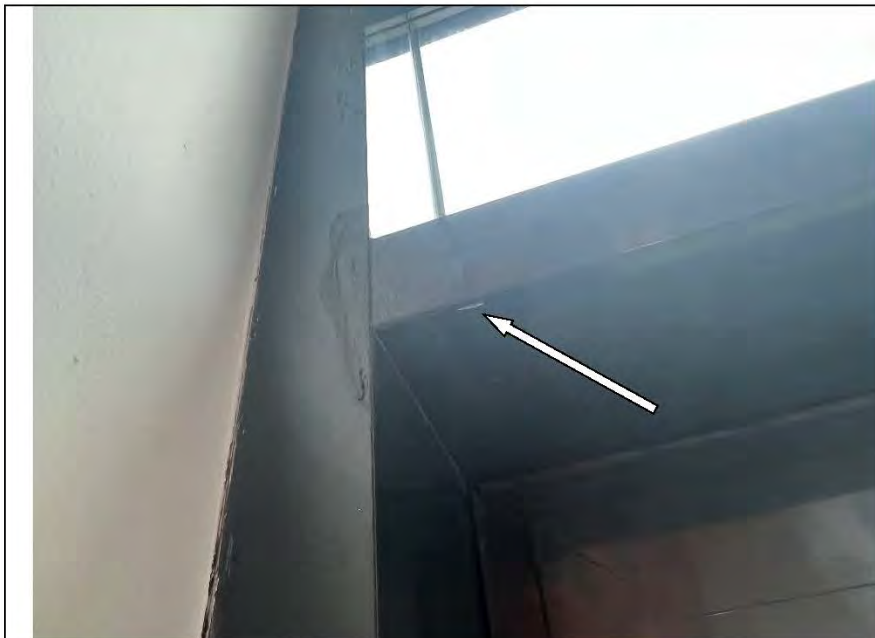
Фото №49. Царапина на металлическом профиле оконного блока в гостиной.
