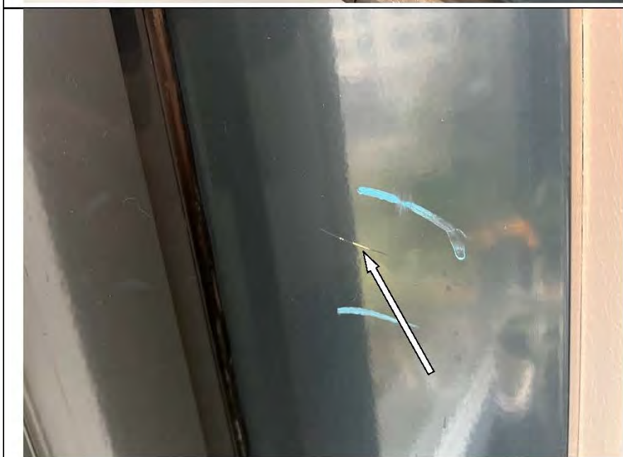
Фото №63. Царапина на металлическом профиле оконного блока в кухне.
