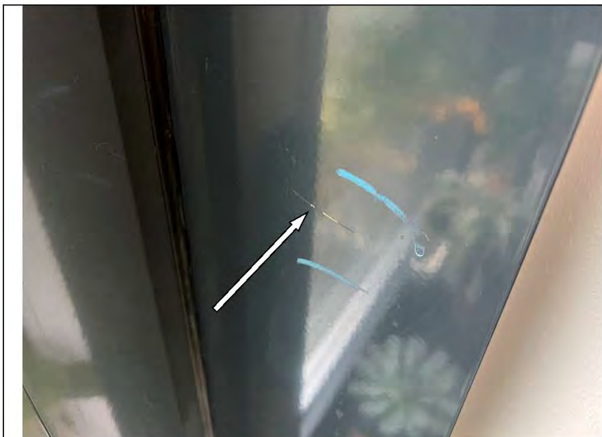
Фото №58. Царапина на металлическом профиле оконного блока в кухне.
