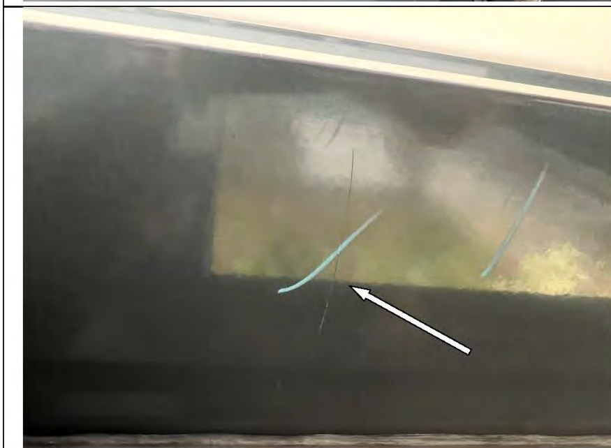
Фото №54. Царапина на металлическом профиле оконного блока в гостиной.
