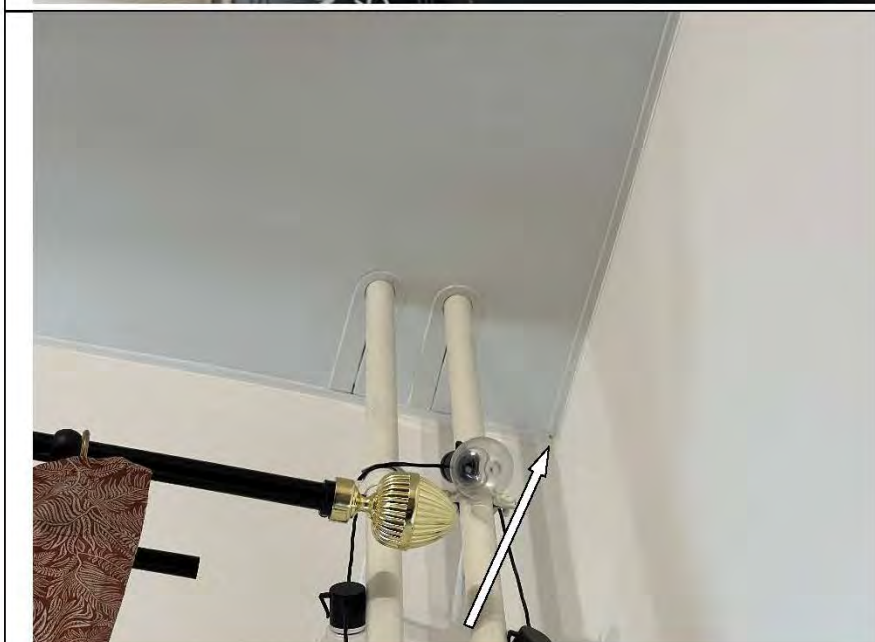
Фото №68. Зазор в стыке монтажа декоративного молдинга в спальне.
