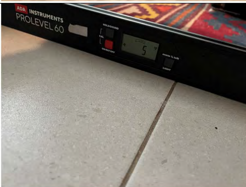
Фото №29. Измерение уровня напольного покрытия в кухне.
