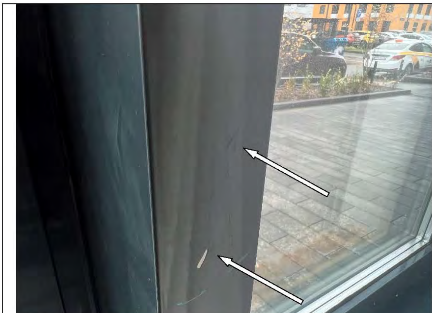
Фото №43. Царапина на металлическом профиле оконного блока в спальне.
