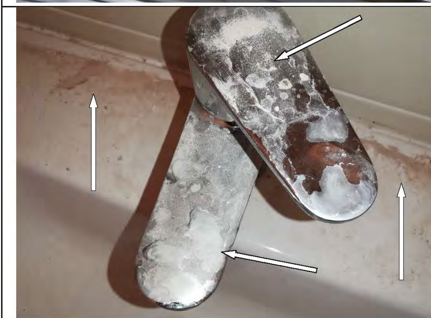
Фото №138. Загрязнение сантехнических приборов в санузле.
