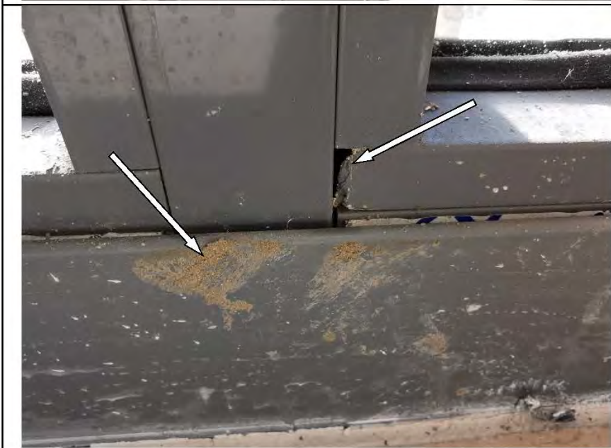
Фото №102. Зазор в месте стыка профилей металлического оконного блока, загрязнение профилей на балконе.
