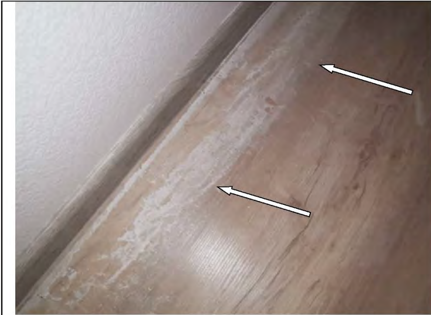
Фото №52. Загрязнение ламината в прихожей.
