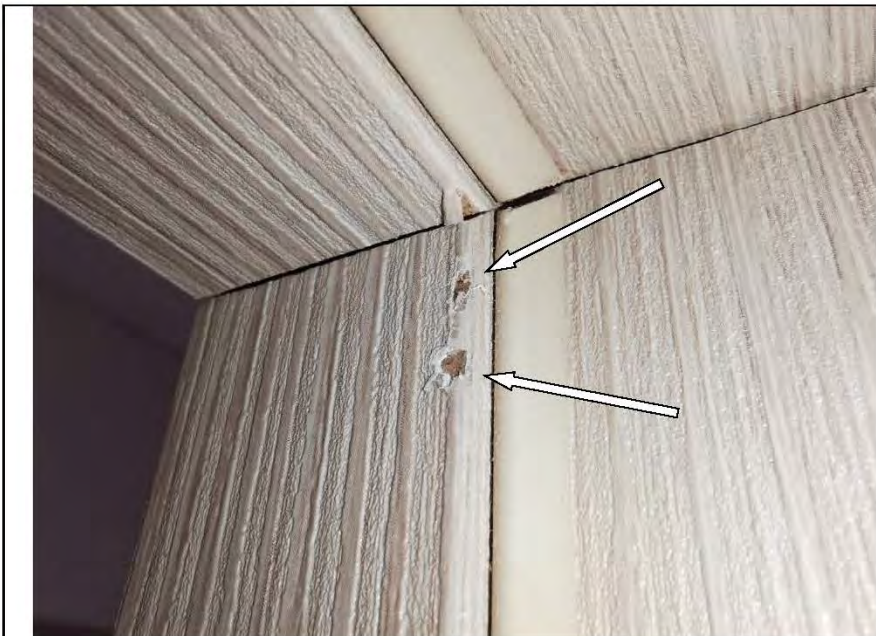
Фото №127. Потертости на коробе деревянного дверного блока в ванной комнате.
