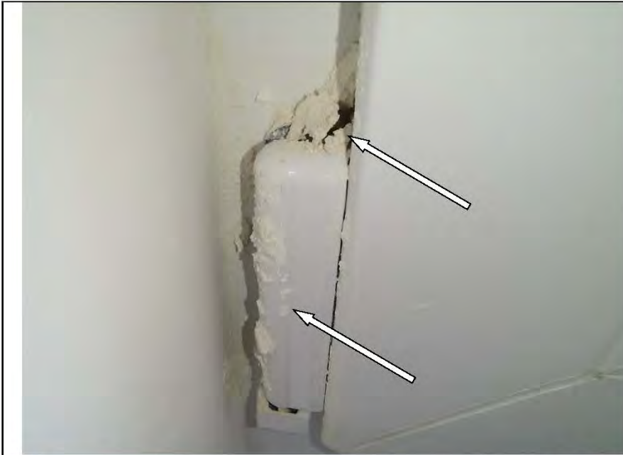
Фото №85. Загрязнение профиля ПВХ оконного блока в спальне.
