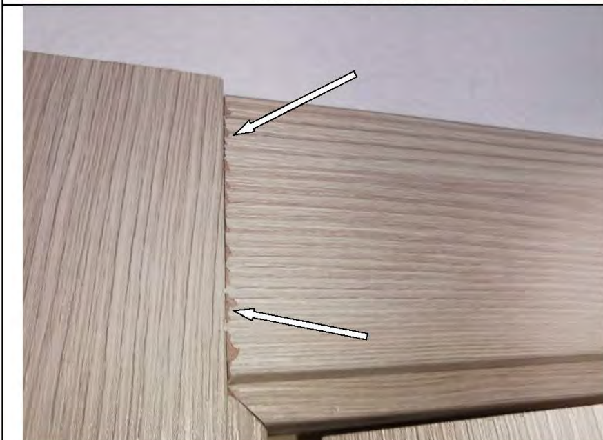
Фото №125. Повреждение ламинации на наличниках деревянного дверного блока в спальне.
