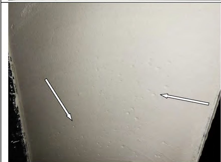
Фото №135. Окрашенные откосы входного дверного блока выполнены с дефектами.
