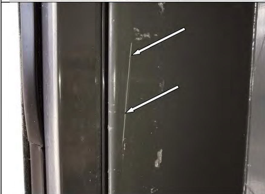
Фото №105. Царапины на профиле металлического оконного блока на балконе.
