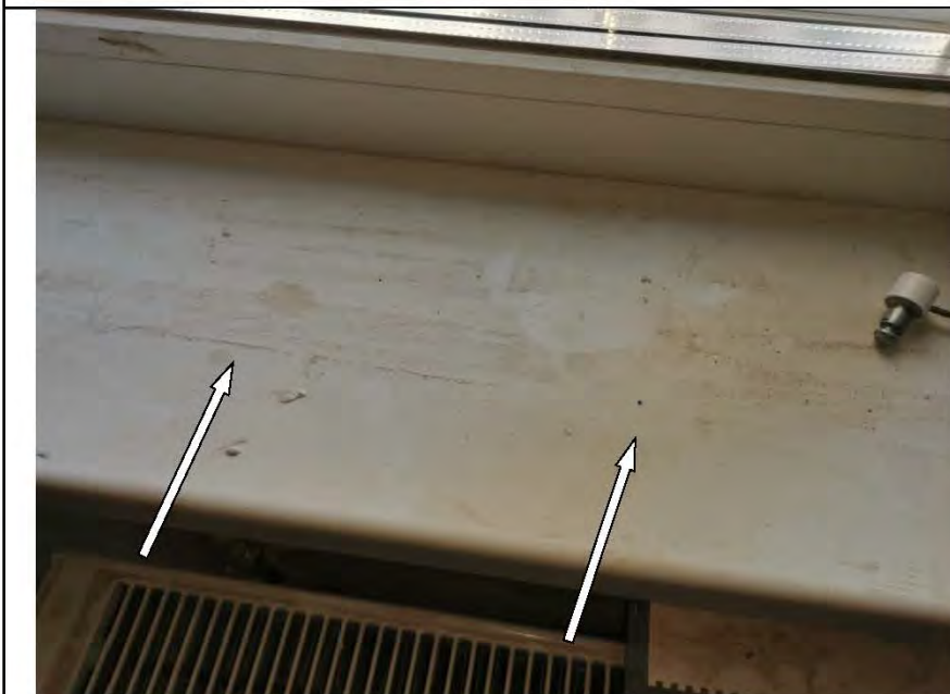
Фото №113. Царапины и загрязнения на лицевой поверхности подоконной доски в кухне имеются дефекты.
