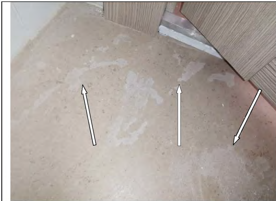
Фото №73. Загрязнение напольной керамической плитки в ванной комнате.
