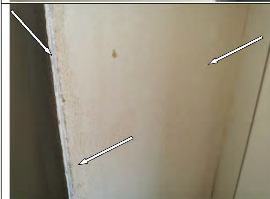
Фото №96. Окрашенные откосы оконного блока ПВХ выполнены с дефектами в кухне.
