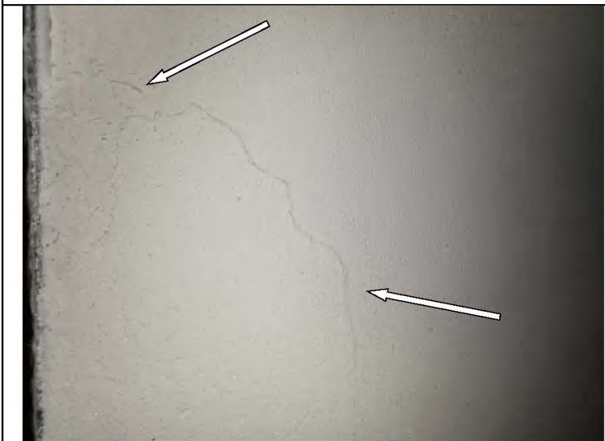
Фото №134. Окрашенные откосы входного дверного блока выполнены с дефектами.
