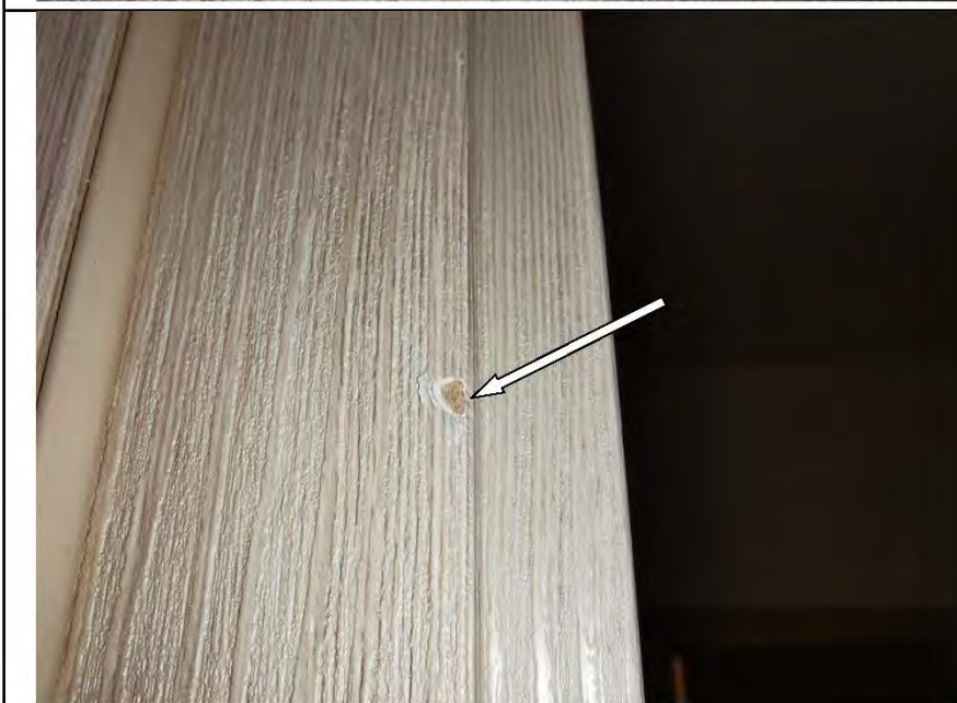
Фото №123. Повреждение ламинации на коробе деревянного дверного блока в кухне.
