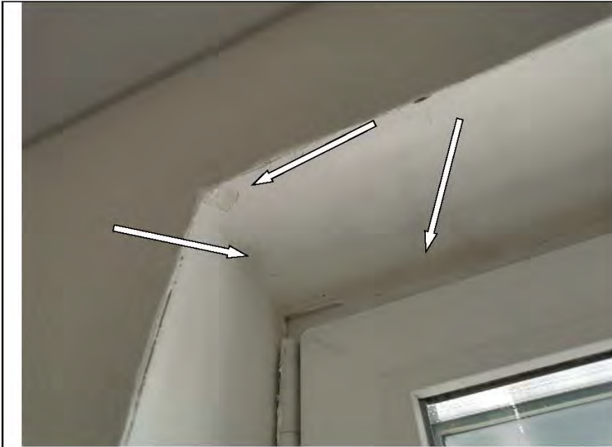
Фото №97. Окрашенные откосы оконного блока ПВХ выполнены с дефектами в спальне.
