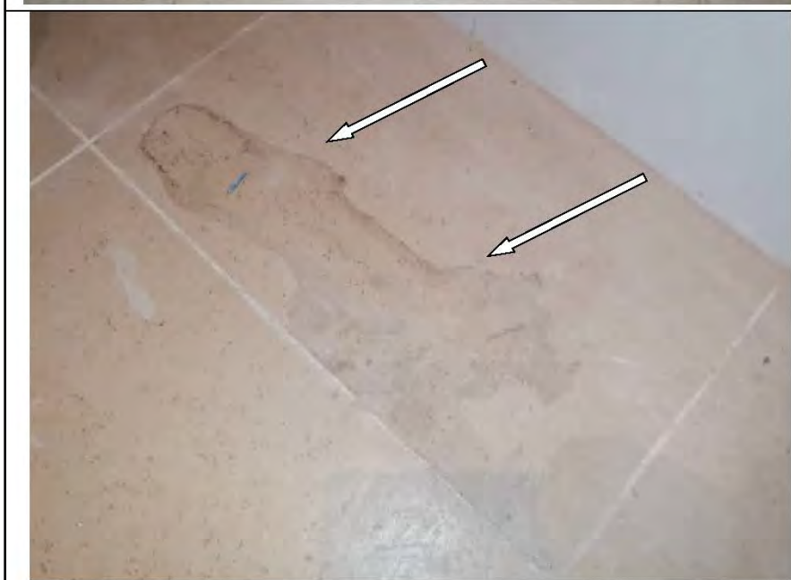
Фото №72. Загрязнение напольной керамической плитки в санузле.
