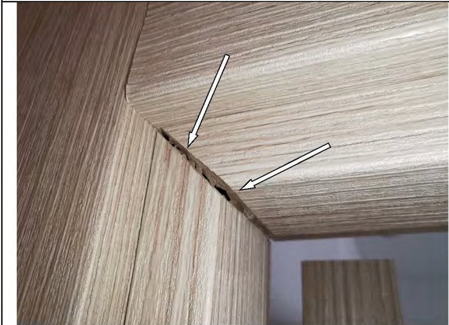
Фото №119. Элементы дверного блока (коробка) соединены не надежно в гостиной.
