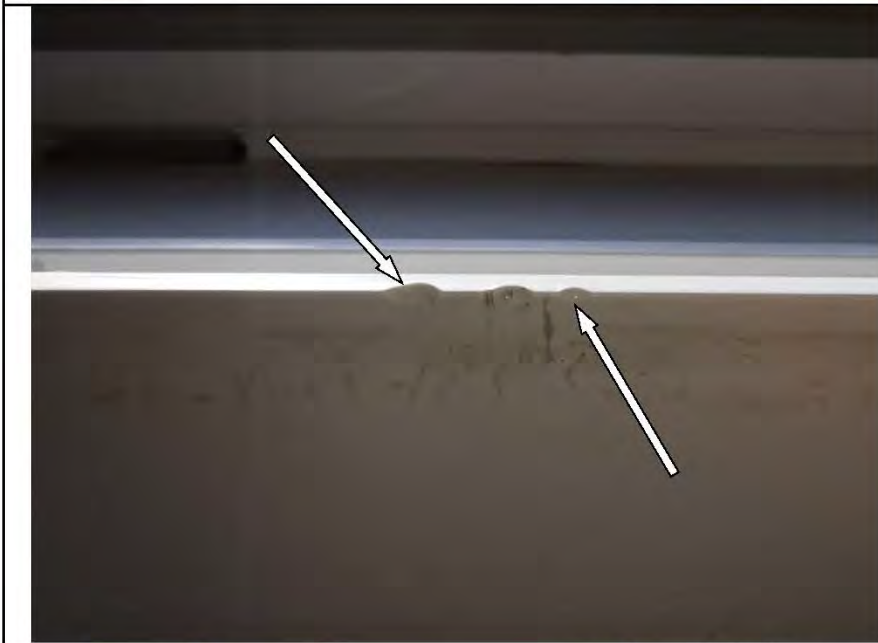
Фото №89. Механическое повреждение профиля ПВХ оконного блока в детской.
