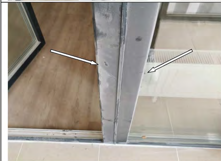
Фото №92. Загрязнение профиля ПВХ оконного и дверного блока в гостиной.
