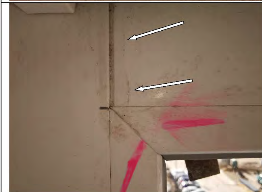
Фото №87. Трещина на профиле ПВХ оконного блока в детской.
