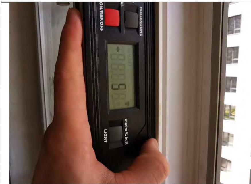
Фото №107. Отклонение ПВХ оконного блока в кухне по уровню вертикальности.
