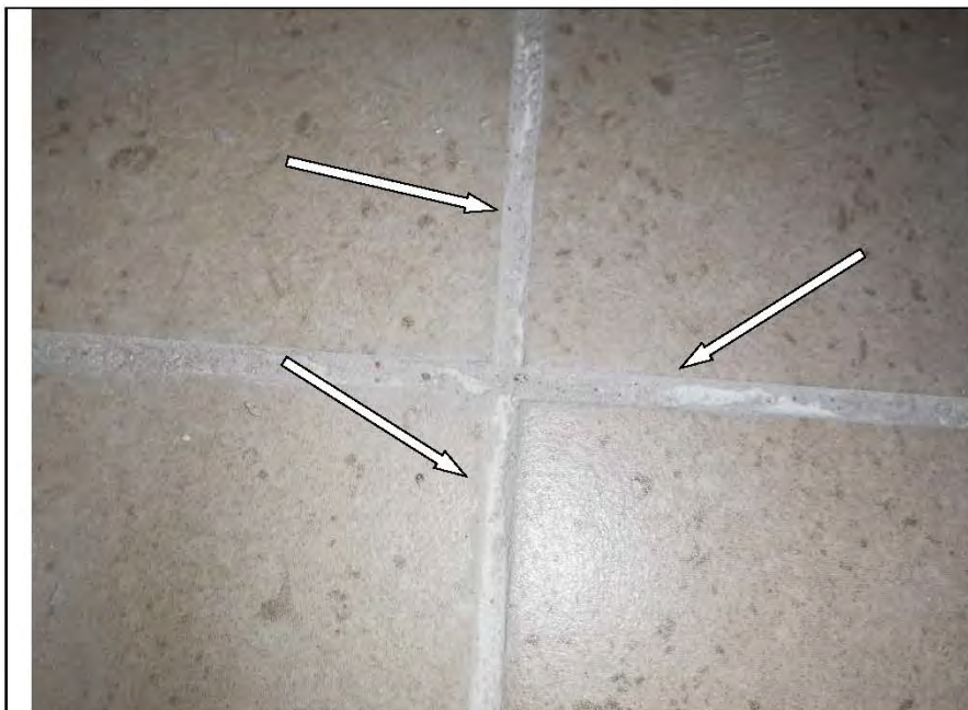
Фото №70. Затирка напольной плитки в ванной комнате выполнена с нарушениями.
