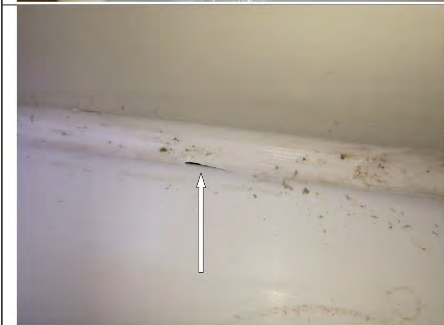
Фото №144. Некачественно выполнена гидроизоляция ванной чаши.
