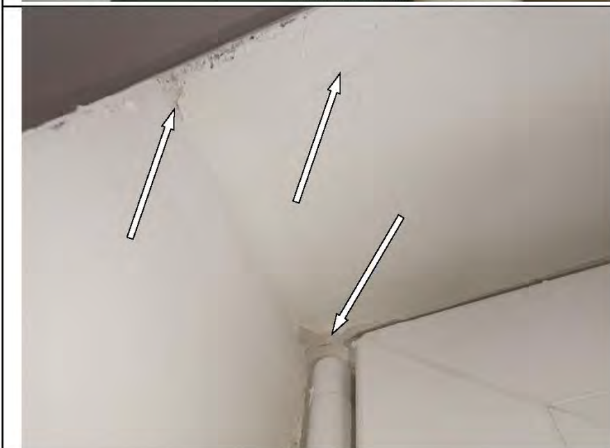
Фото №99. Окрашенные откосы оконного блока ПВХ выполнены с дефектами в гостиной.
