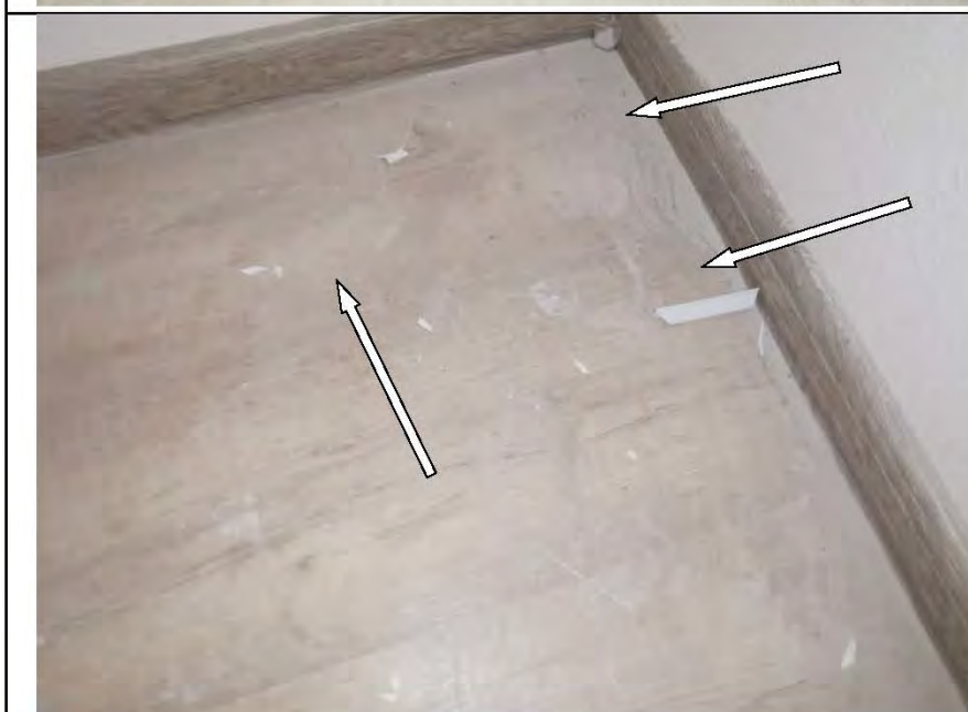
Фото №51. Загрязнение ламината в прихожей.
