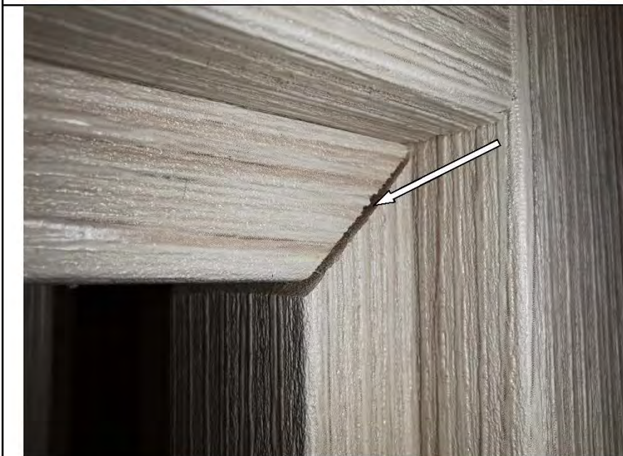
Фото №116. Элементы дверного блока (коробка) соединены не надежно в санузле.
