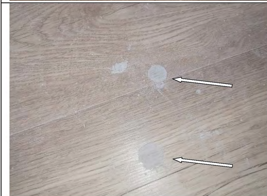
Фото №54. Загрязнение ламината в коридоре.
