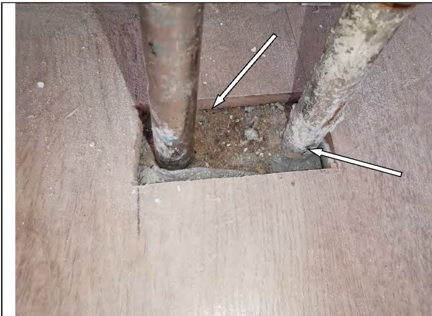
Фото №61. Заделка отверстия для трубопровода отопления в напольном покрытии из ламината выполнена с дефектом в детской.
