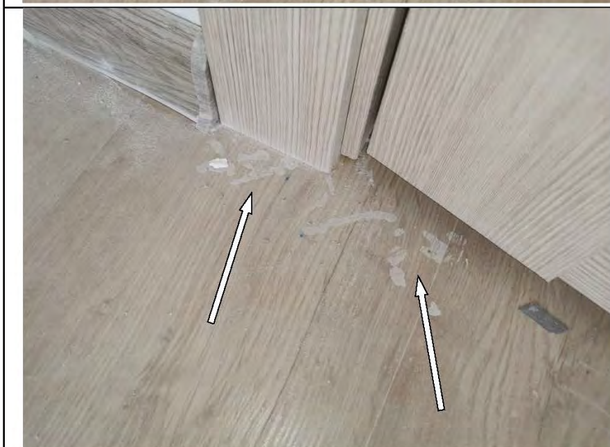
Фото №57. Загрязнение ламината в спальне.
