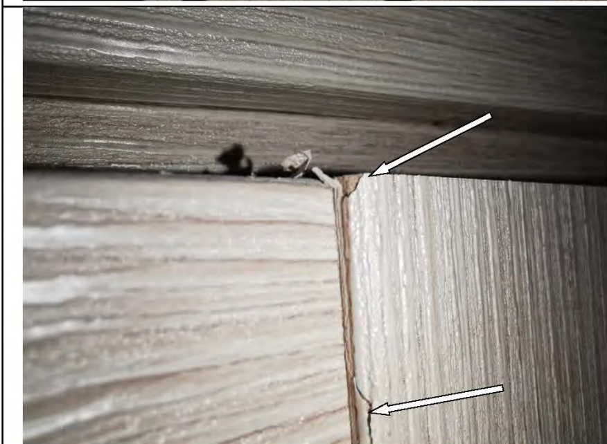
Фото №129. Повреждение ламинации на полотне деревянного дверного блока в гостиной.
