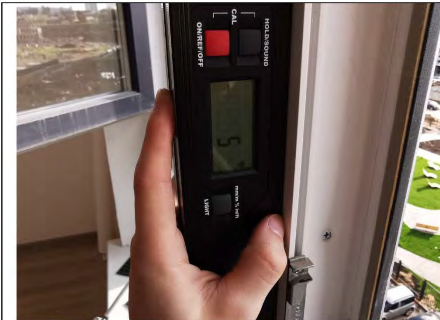
Фото №109. Отклонение ПВХ оконного блока в детской по уровню вертикальности.
