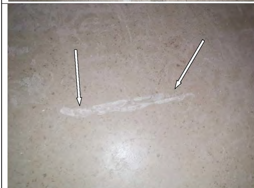
Фото №71. Загрязнение затирочным раствором напольной керамической плитки в санузле.
