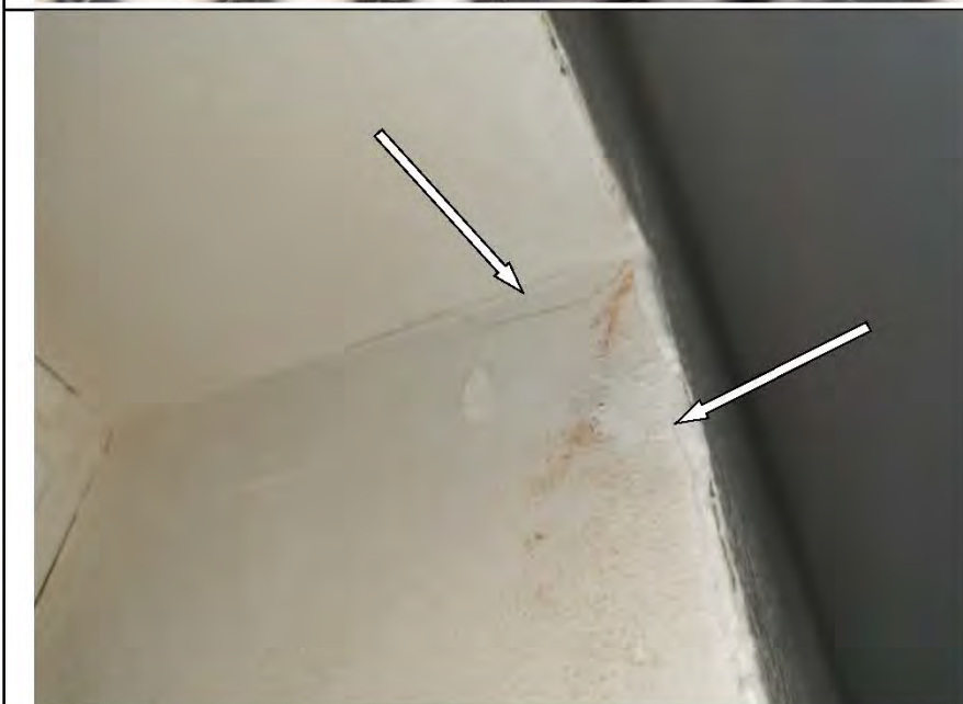
Фото №95. Окрашенные откосы оконного блока ПВХ выполнены с дефектами в кухне.
