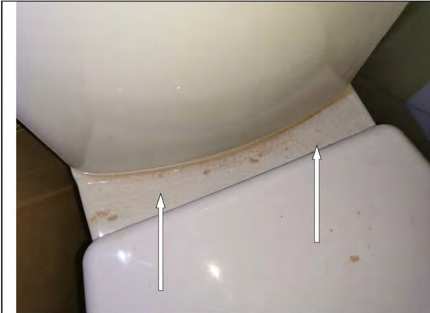
Фото №142. Загрязнение сантехнических приборов в ванной комнате.
