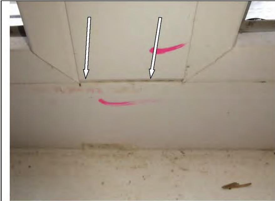
Фото №82. Зазор в месте стыка профилей ПВХ оконного блока в спальне.
