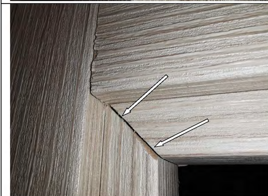
Фото №117. Элементы дверного блока (коробка) соединены не надежно в ванной комнате.
