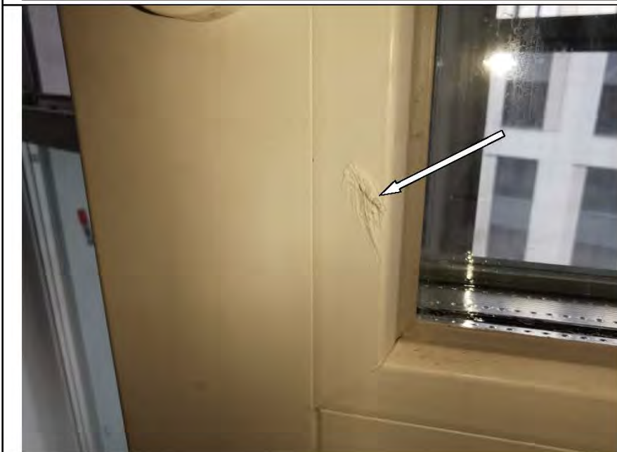
Фото №90. Механическое повреждение профиля ПВХ дверного блока в гостиной.
