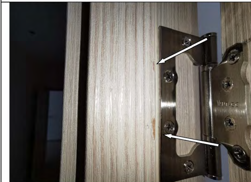
Фото №128. Потертости на коробе деревянного дверного блока в детской.
