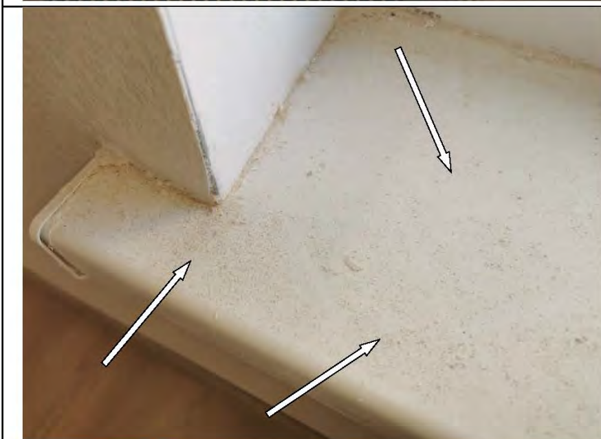
Фото №114. Царапины и загрязнения на лицевой поверхности подоконной доски в спальне имеются дефекты.
