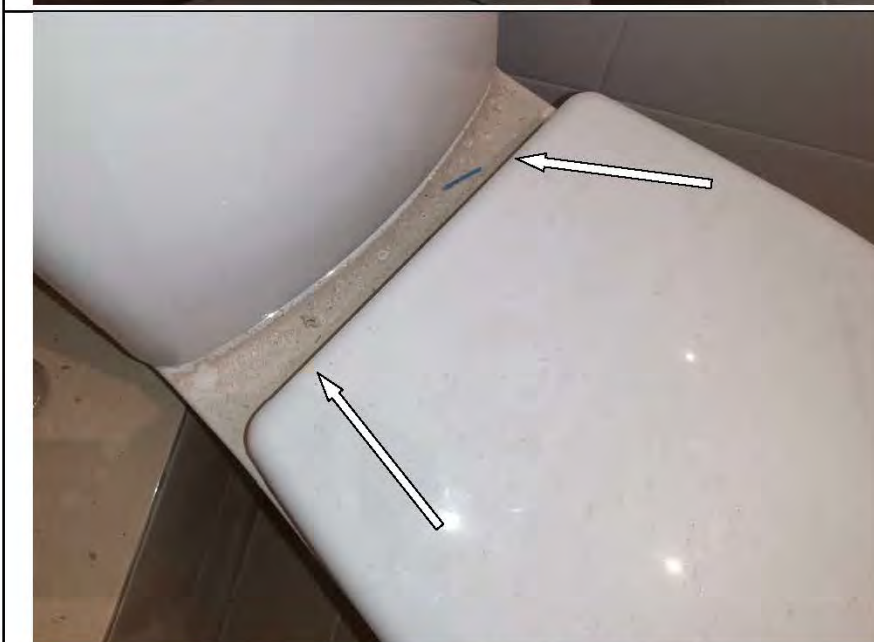
Фото №140. Загрязнение сантехнических приборов в санузле.
