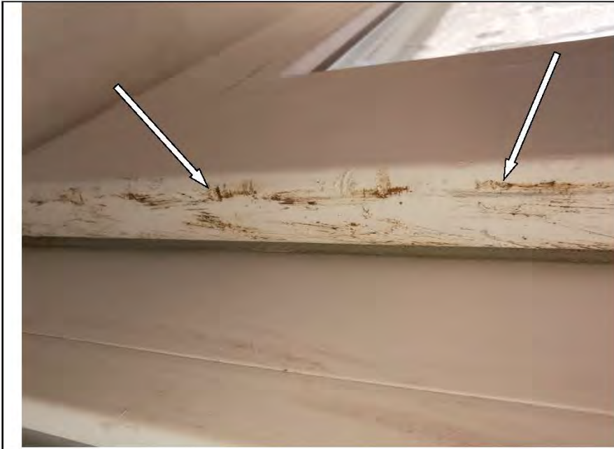
Фото №88. Царапины, потертости на профиле ПВХ оконного блока в детской.
