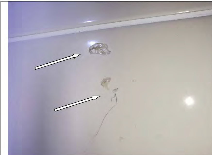
Фото №43. Загрязнение настенной керамической плитки в ванной комнате.
