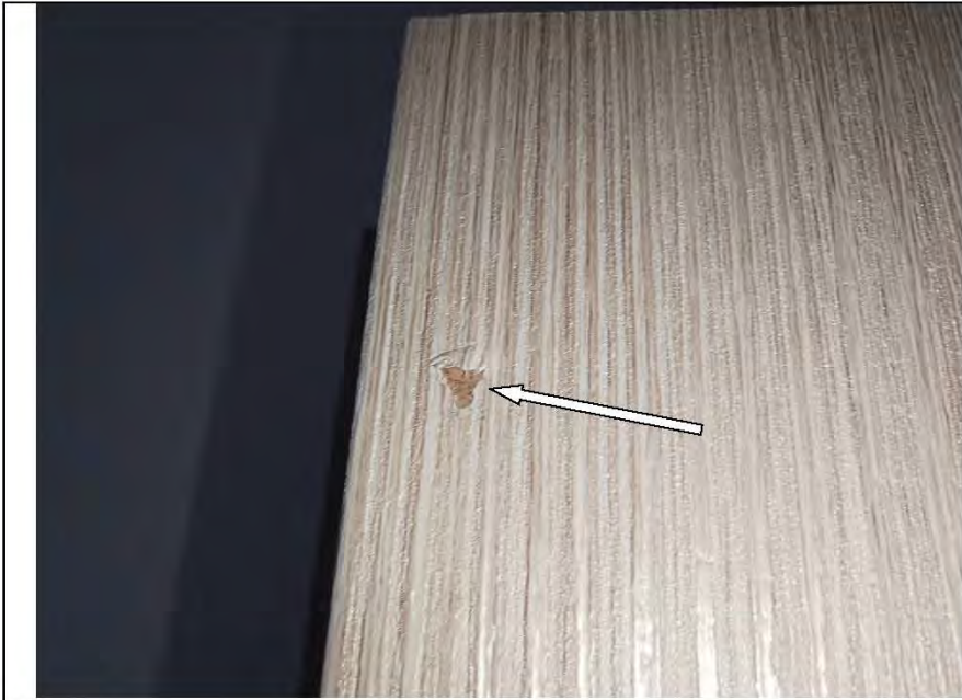
Фото №130. Повреждение ламинации на полотне деревянного дверного блока в гостиной.
