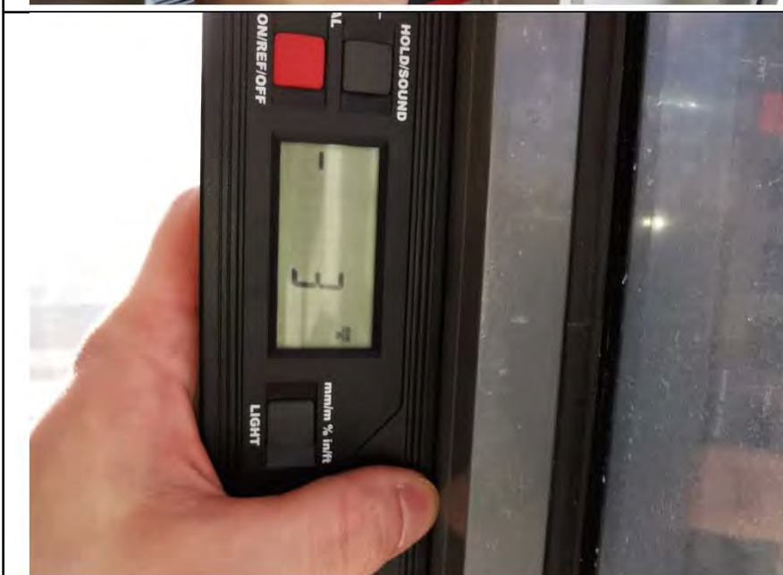
Фото №111. Отклонение металлического оконного блока на балконе по уровню вертикальности.
