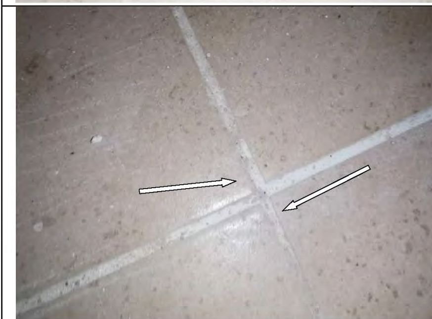
Фото №69. Затирка напольной плитки в санузле выполнена с нарушениями.
