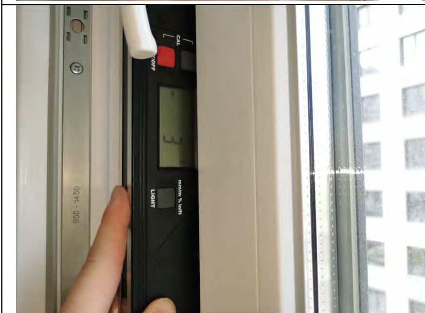
Фото №108. Отклонение ПВХ оконного блока в спальне по уровню вертикальности.
