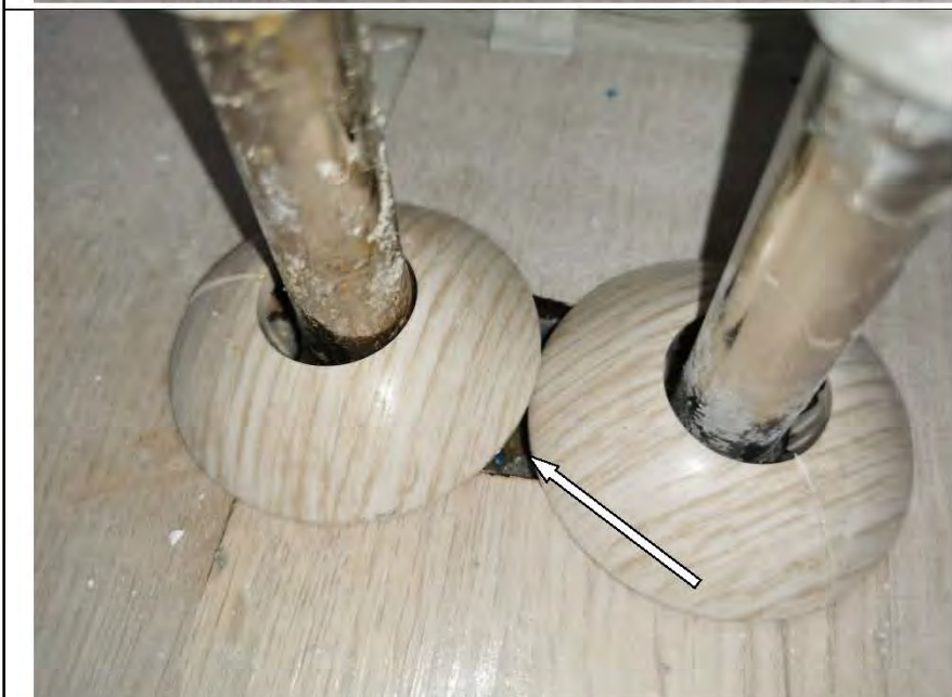
Фото №60. Заделка отверстия для трубопровода отопления в напольном покрытии из ламината выполнена с дефектом в спальне.
