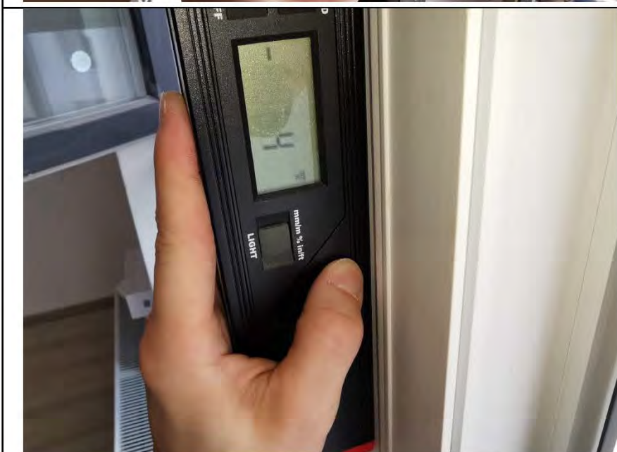
Фото №110. Отклонение ПВХ оконного блока в гостиной по уровню вертикальности.
