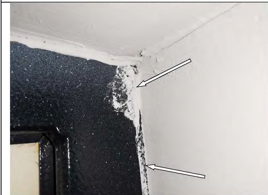
Фото №131. Загрязнение короба входного дверного блока.
