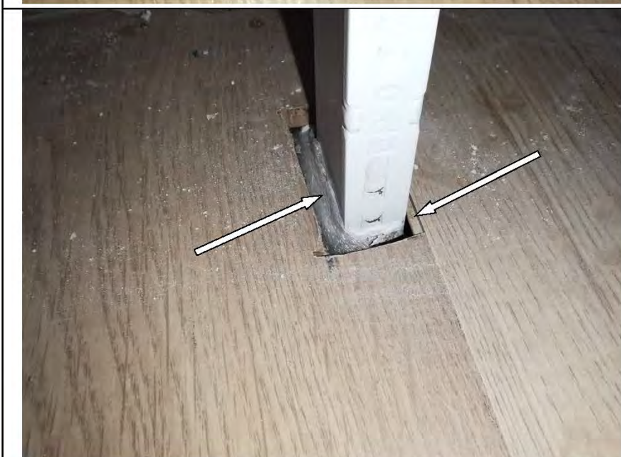
Фото №63. Заделка отверстия для трубопровода отопления в напольном покрытии из ламината выполнена с дефектом в гостиной.
