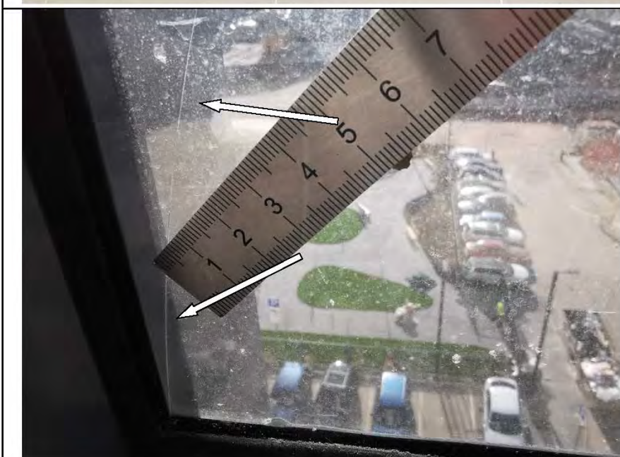
Фото №93. На стеклопакете металлического оконного блока на балконе имеются дефекты (царапины, загрязнения).
