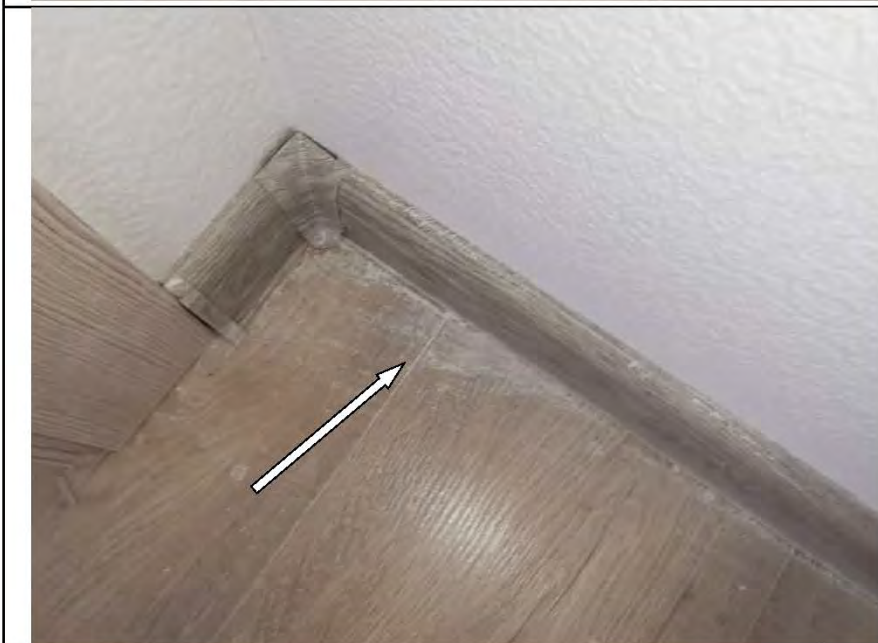
Фото №53. Загрязнение ламината в коридоре.
