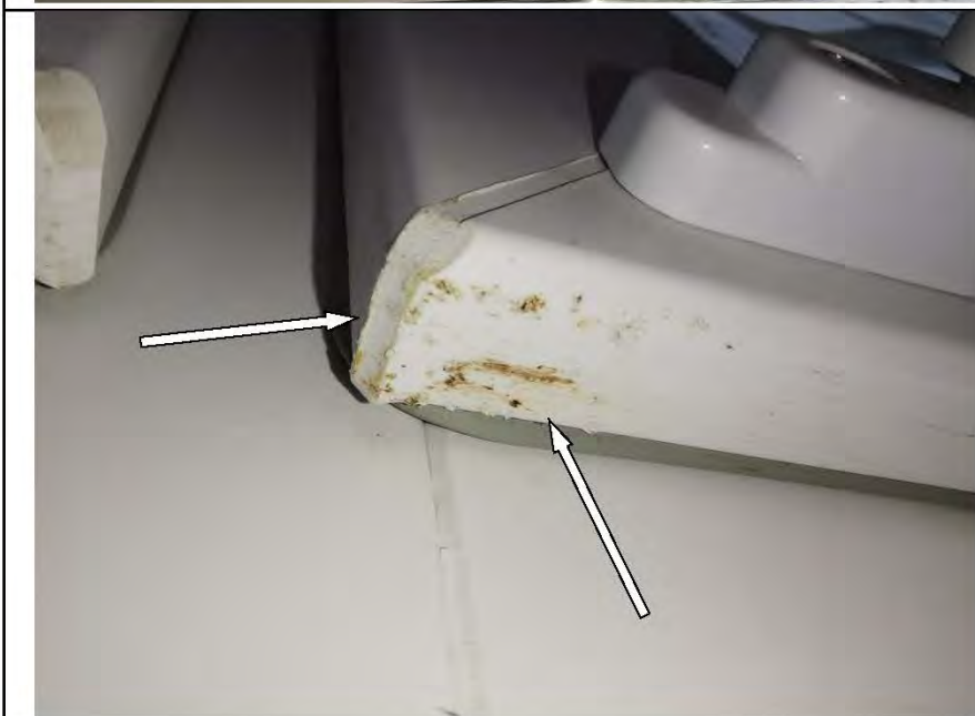
Фото №84. Потертости на профиле ПВХ оконного блока в спальне.
