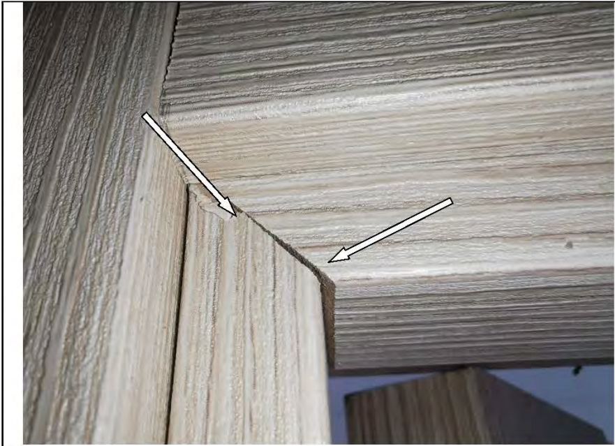
Фото №118. Элементы дверного блока (коробка) соединены не надежно в детской.
