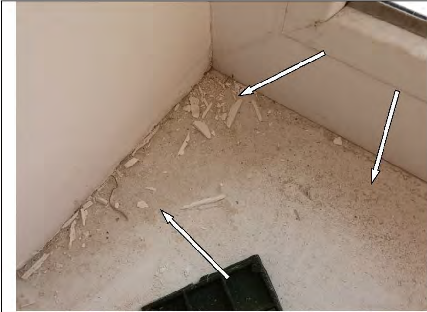
Фото №115. Царапины и загрязнения на лицевой поверхности подоконной доски в детской имеются дефекты.
