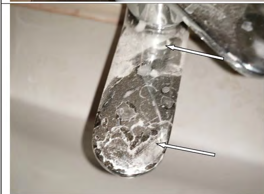
Фото №141. Загрязнение сантехнических приборов в ванной комнате.
