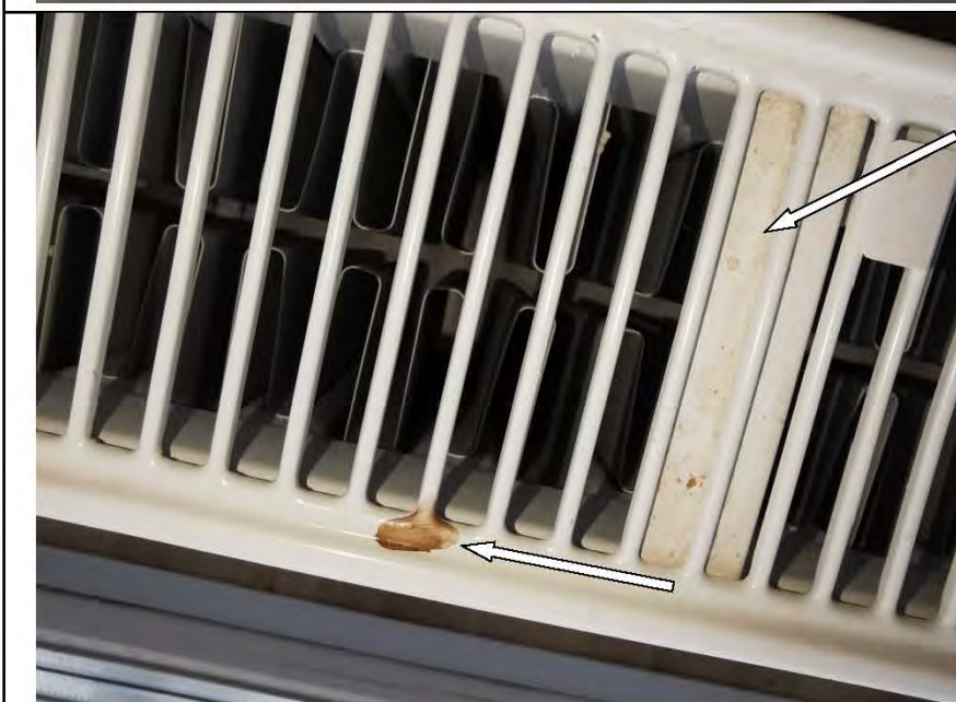
Фото №137. Загрязнение на радиаторе в кухне.
