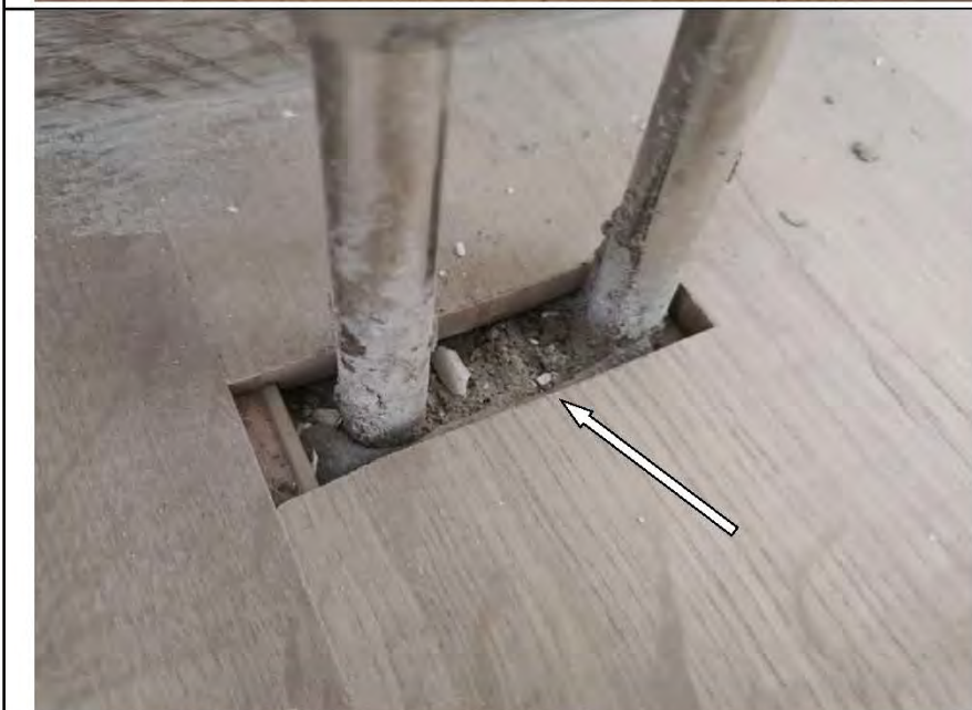
Фото №59. Заделка отверстия для трубопровода отопления в напольном покрытии из ламината выполнена с дефектом в кухне.
