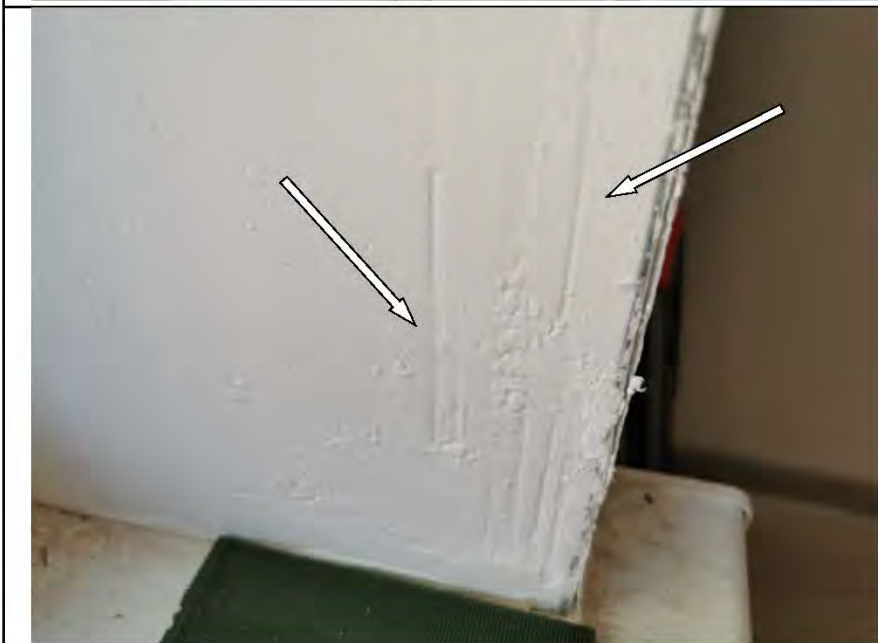
Фото №98. Окрашенные откосы оконного блока ПВХ выполнены с дефектами в спальне.
