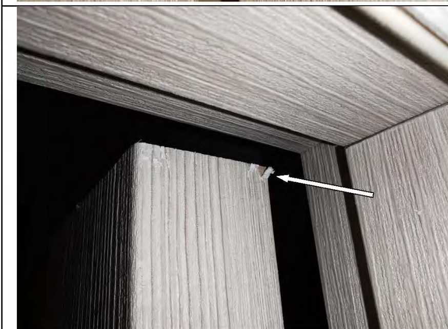
Фото №126. Повреждение ламинации на полотне деревянного дверного блока в ванной комнате.
