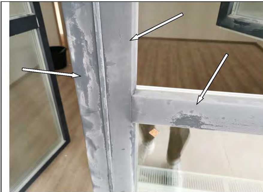
Фото №91. Загрязнение профиля ПВХ оконного и дверного блока в гостиной.
