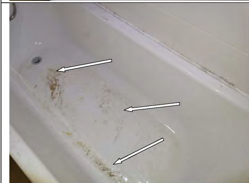
Фото №143. Загрязнение сантехнических приборов в ванной комнате.
