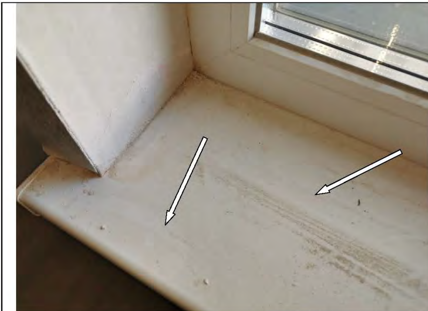
Фото №112. Царапины и загрязнения на лицевой поверхности подоконной доски в кухне имеются дефекты.
