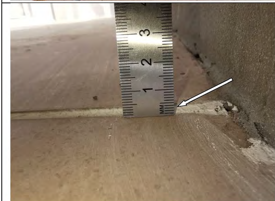
Фото №75. Уступы керамической плитки пола более 2 мм на балконе.
