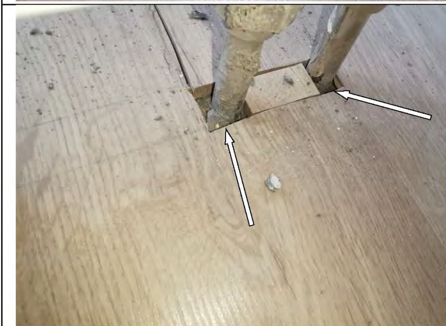
Фото №62. Заделка отверстия для трубопровода отопления в напольном покрытии из ламината выполнена с дефектом в гостиной.
