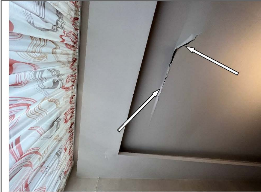
Фото №13. Разрушение конструкции подвесного потолка в спальне.
