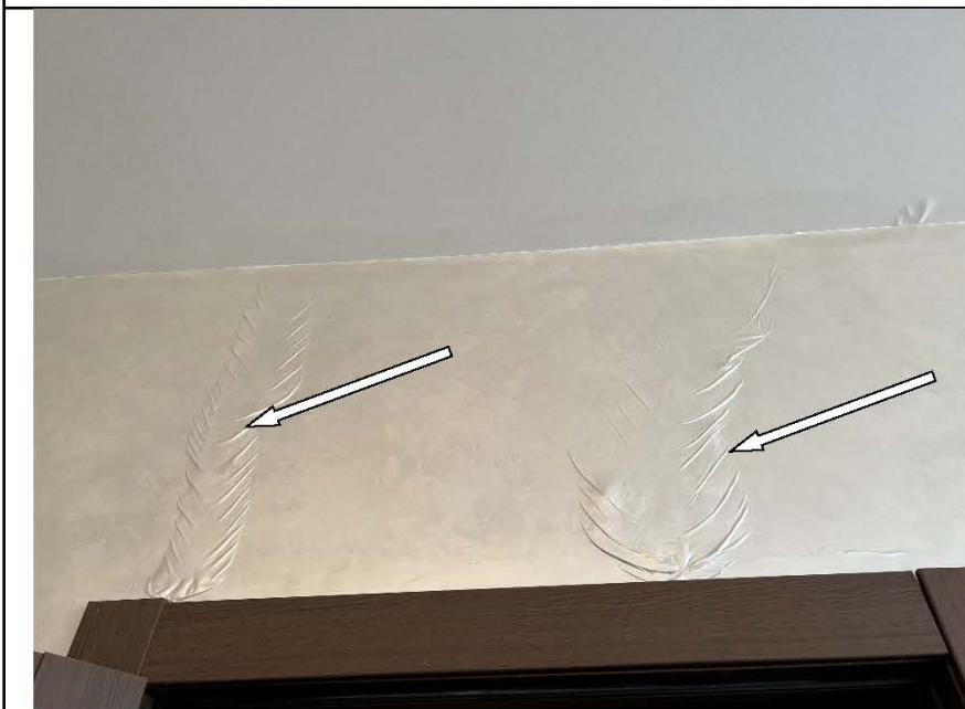
Фото №5. Подтеки отделочного покрытия на стенах в спальне.
