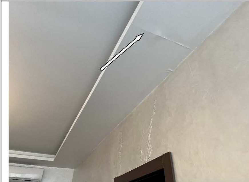
Фото №14. Разрушение конструкции подвесного потолка в спальне.
