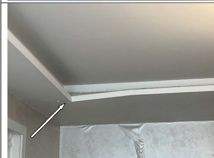
Фото №12. Разрушение конструкции подвесного потолка в спальне.
