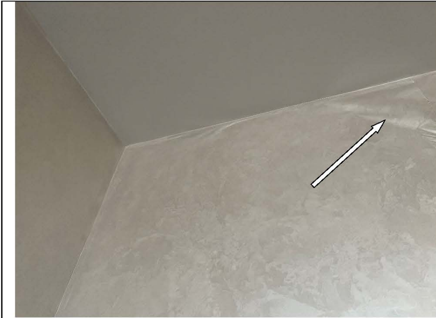
Фото №4. Подтеки отделочного покрытия на стенах в спальне.
