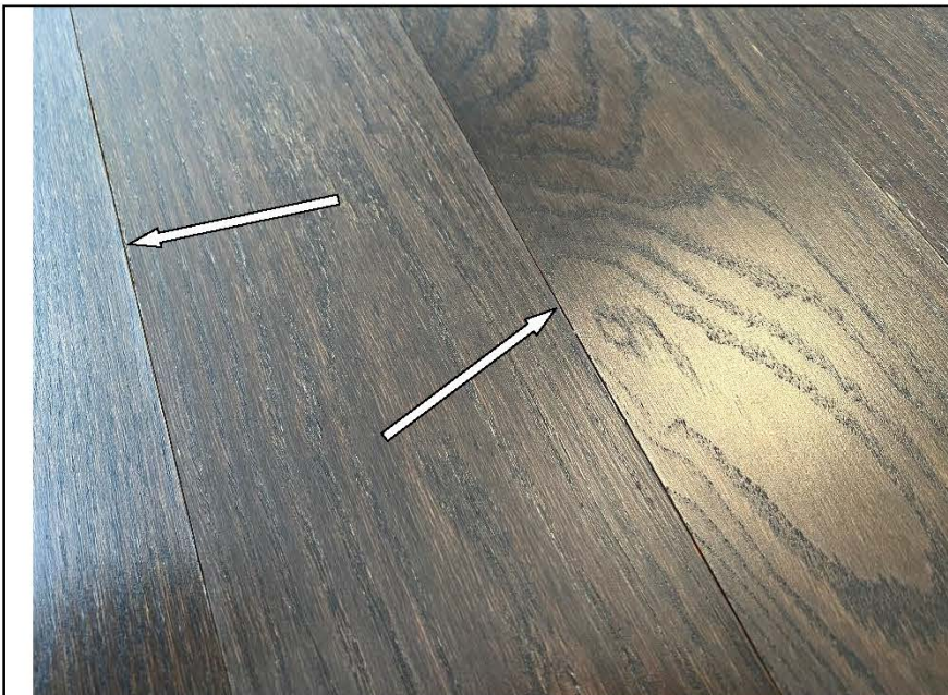
Фото №7. Вздутие и поднятые кромки паркетных досок в спальне.
