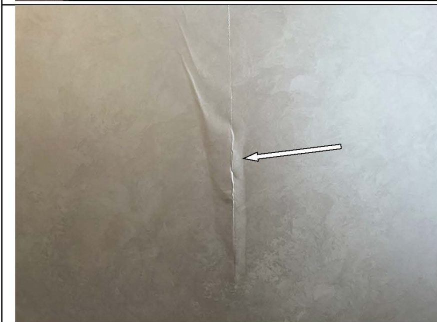
Фото №6. Подтеки отделочного покрытия на стенах в спальне.
