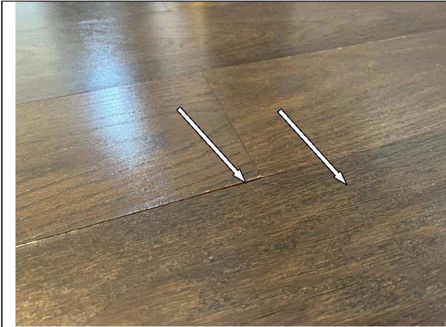
Фото №10. Вздутие и поднятые кромки паркетных досок в спальне.
