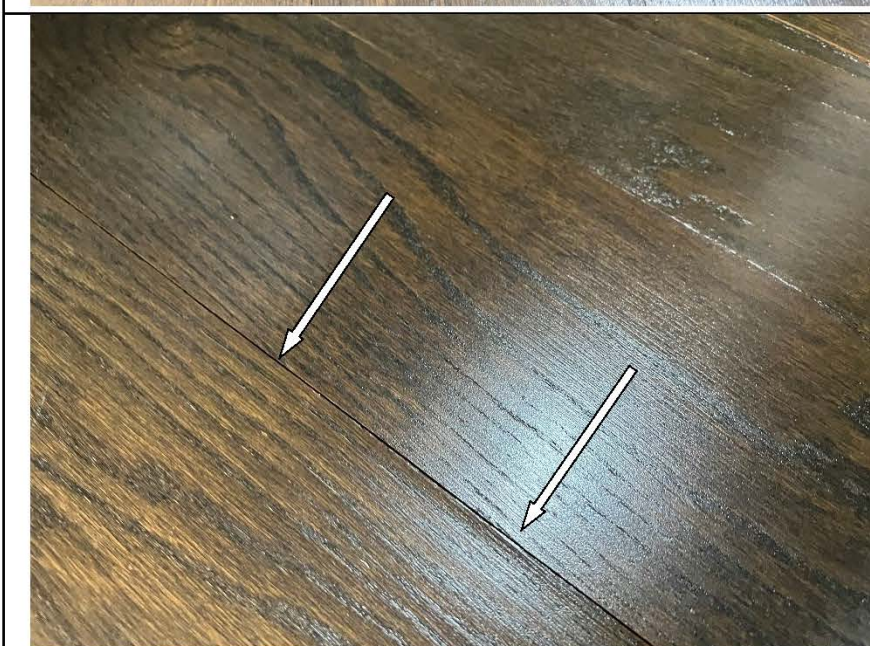
Фото №9. Вздутие и поднятые кромки паркетных досок в гардеробной.
