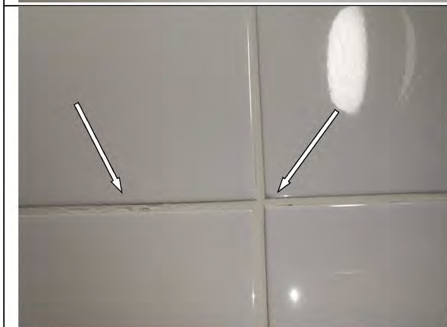
Фото №23. Затирка настенной плитки в ванной комнате выполнена с нарушениями.
