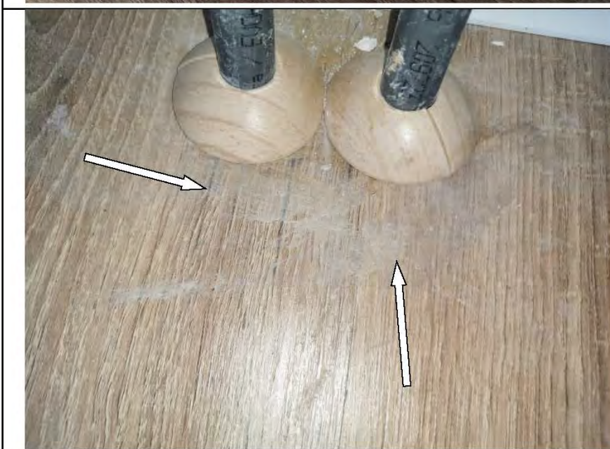
Фото №30. Загрязнение ламината в спальне.
