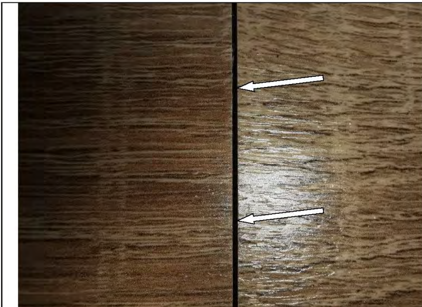
Фото №34. Зазоры между соседними досками ламината в кухне.
