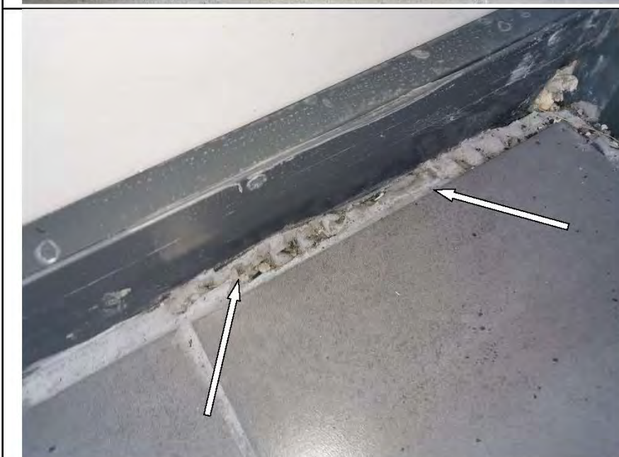
Фото №81. Затирка напольной плитки на лоджии выполнена с нарушениями (пропуски затирочного состава, неравномерное заполнение швов).
