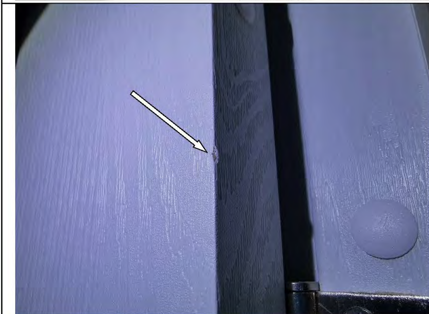
Фото №68. Смятие грани на полотне деревянного дверного блока в ванной комнате.
