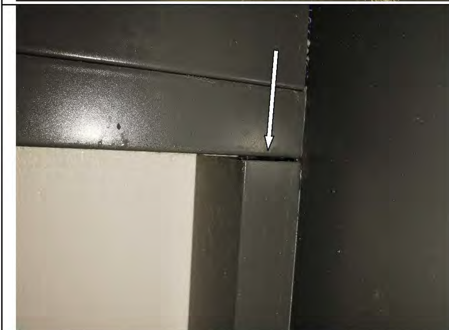
Фото №84. Дефект на металлическом профиле (зазор) оконного блока на лоджии.
