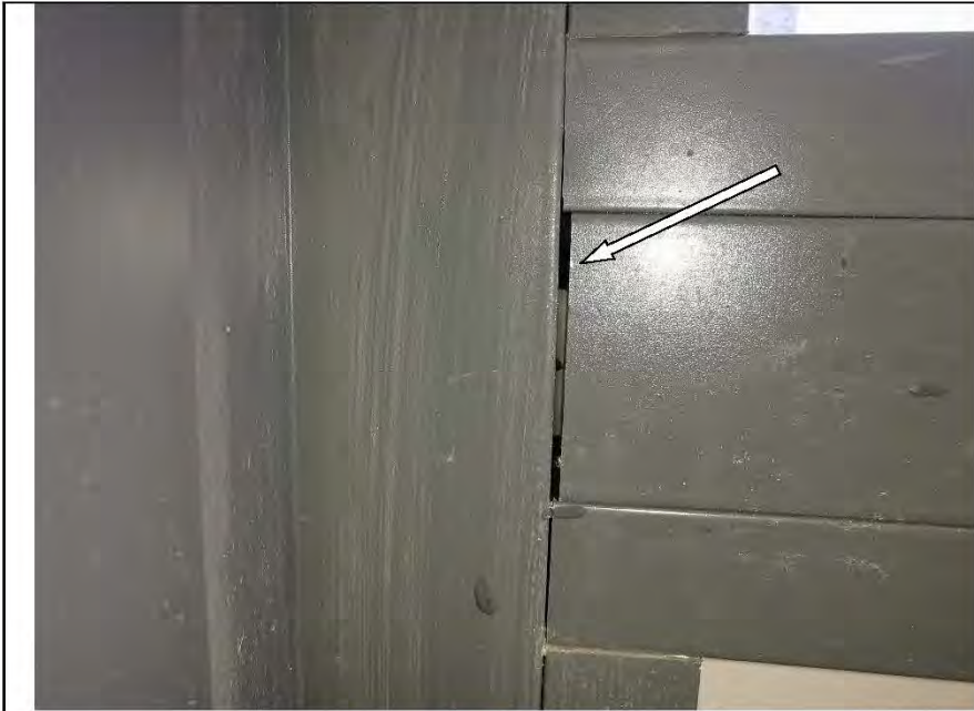
Фото №82. Дефект на металлическом профиле (зазор) оконного блока на лоджии.
