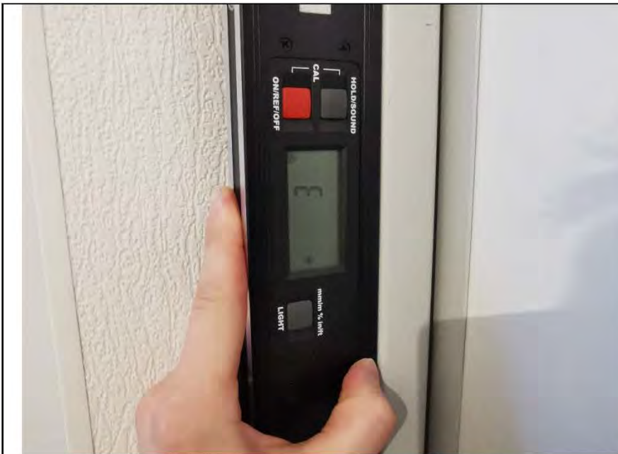
Фото №76. Отклонение коробки входного дверного блока.
