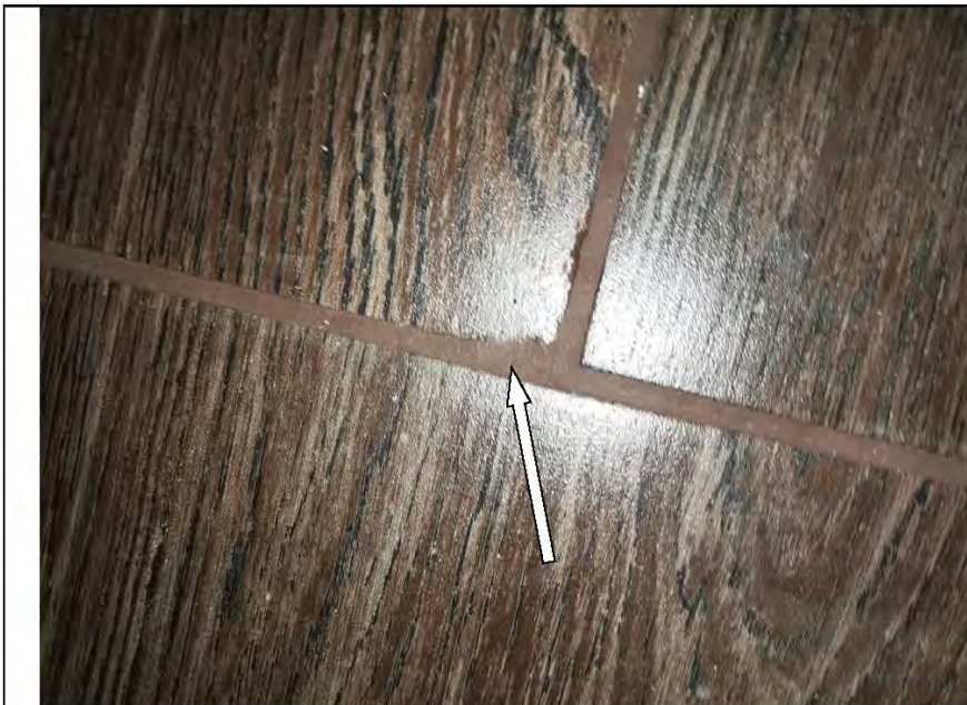
Фото №37. Затирка напольной плитки в санузле выполнена с нарушениями.
