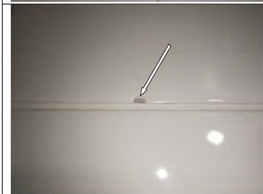
Фото №24. Отбитости на настенной керамической плитке в ванной комнате.
