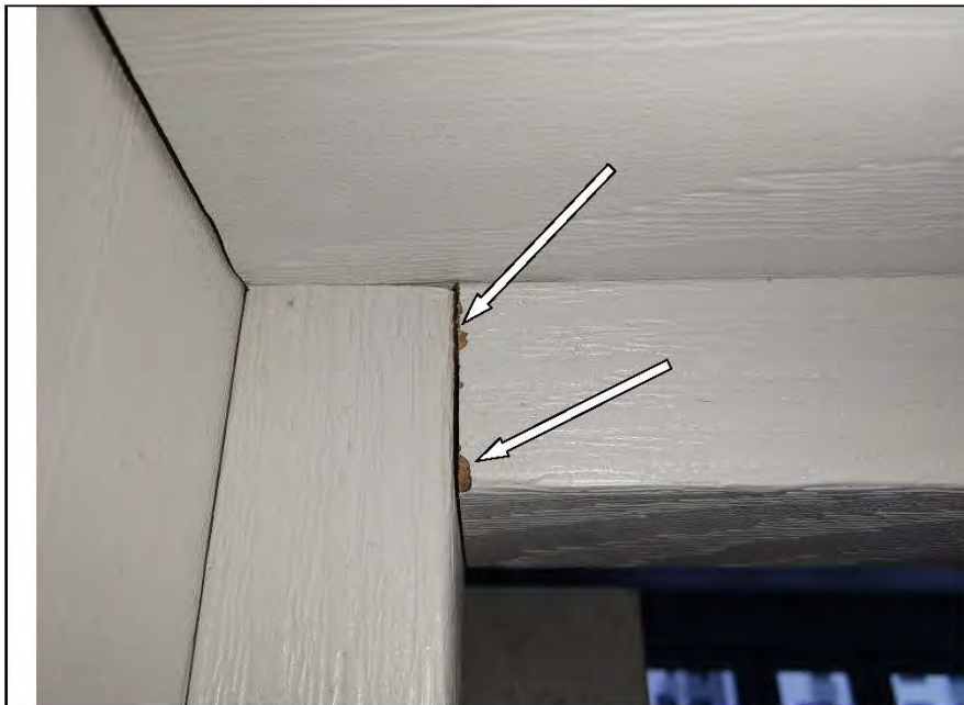
Фото №70. Потертости на коробе деревянного дверного блока в спальне.
