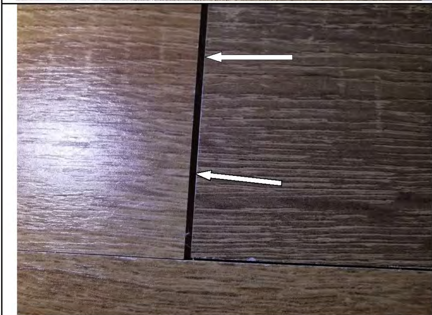
Фото №33. Зазоры между соседними досками ламината в детской.
