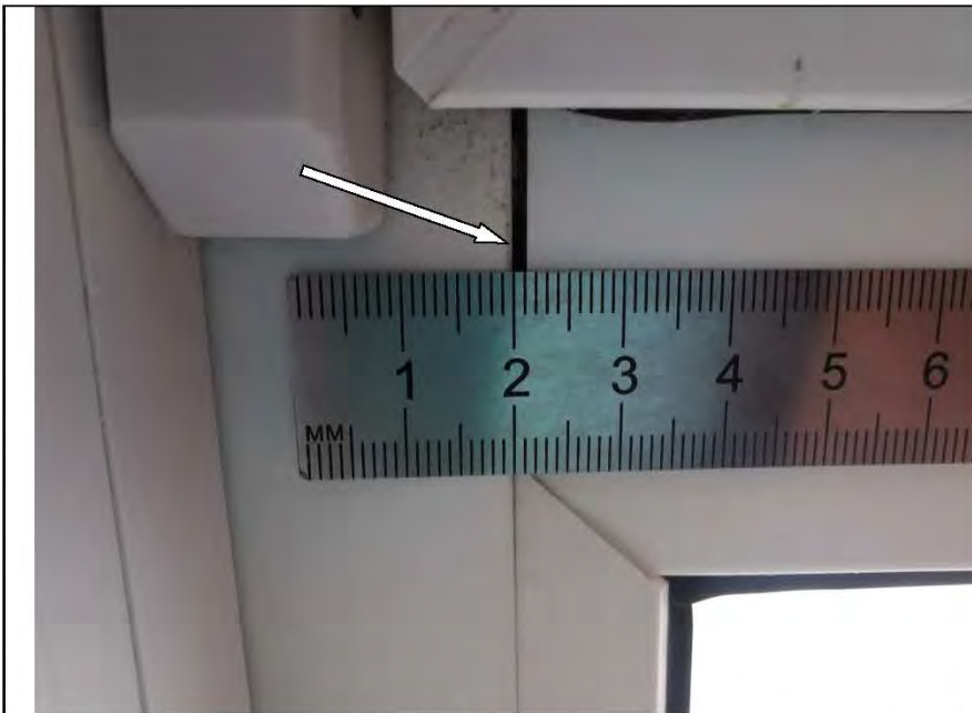
Фото №52. Зазор в месте стыка профилей ПВХ оконного блока в детской.
