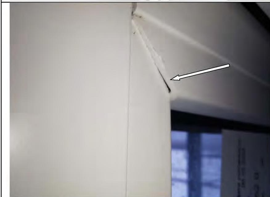
Фото №50. Зазор в месте стыка профилей ПВХ оконного блока в спальне.
