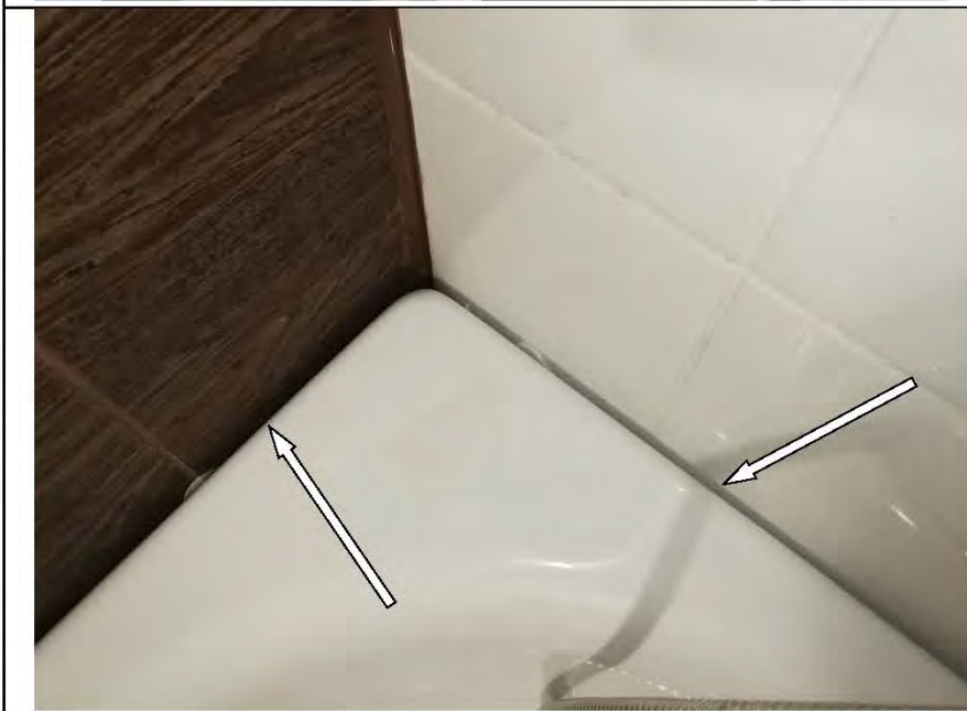
Фото №89. Не загерметизирован стык ванны со стеной.
