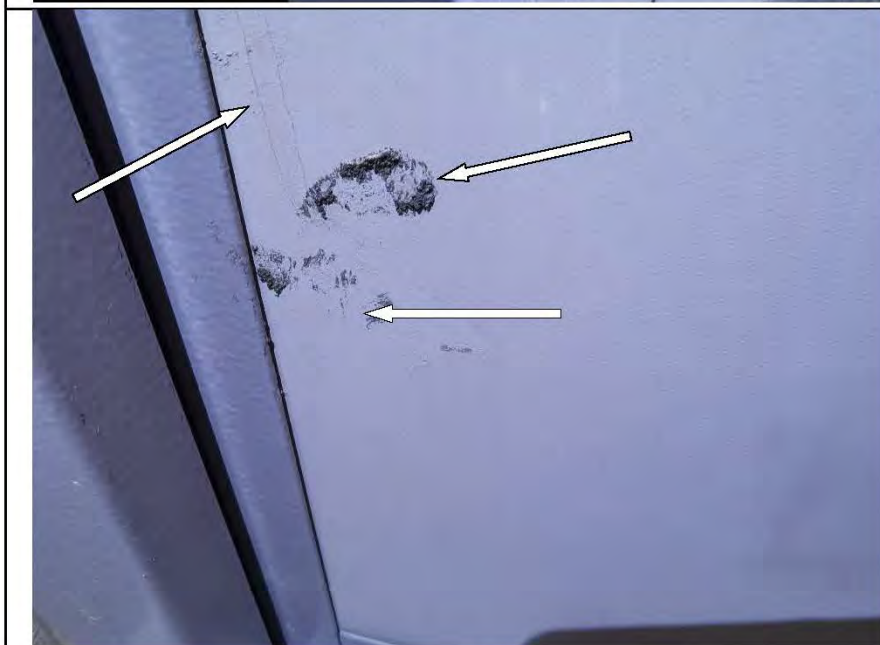
Фото №74. Царапины и загрязнения на полотне входного дверного блока.
