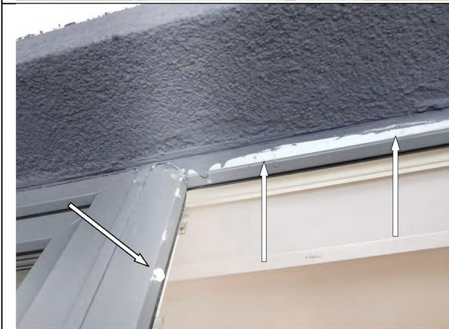
Фото №56. Потертости и загрязнения на профиле ПВХ дверного блока на кухне.
