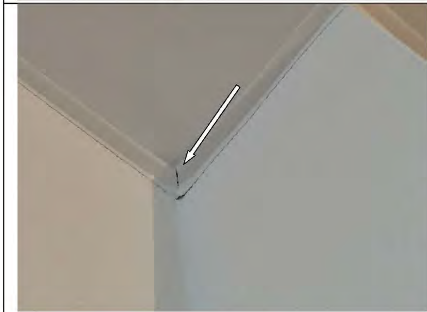
Фото №47. Дефект монтажа декоративного молдинга крепления натяжного потолка в кухне.
