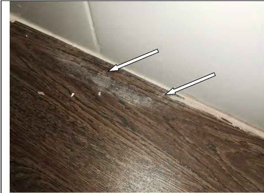
Фото №40. Загрязнение затирочным раствором напольной керамической плитки в ванной комнате.
