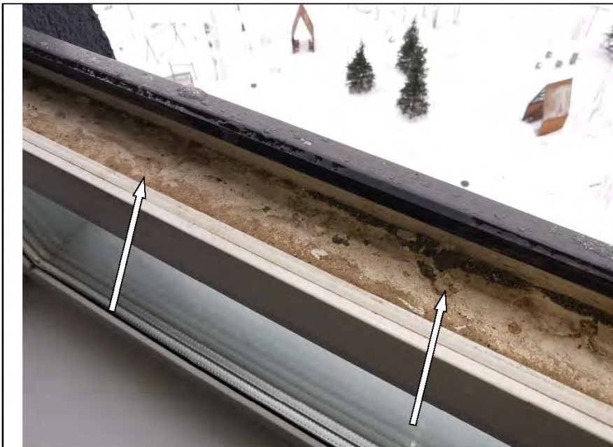
Фото №49. Загрязнение профиля ПВХ оконного блока в спальне.
