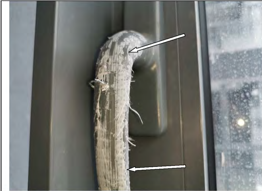
Фото №88. Дефект на металлическом профиле оконного блока на лоджии (царапины).
