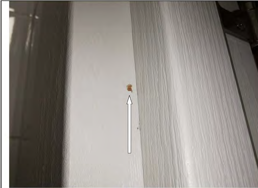
Фото №67. Потертости на коробе деревянного дверного блока в санузле.
