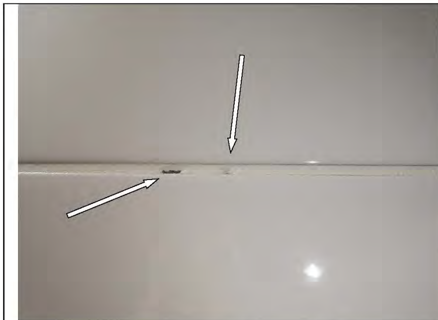
Фото №22. Затирка настенной плитки в ванной комнате выполнена с нарушениями.
