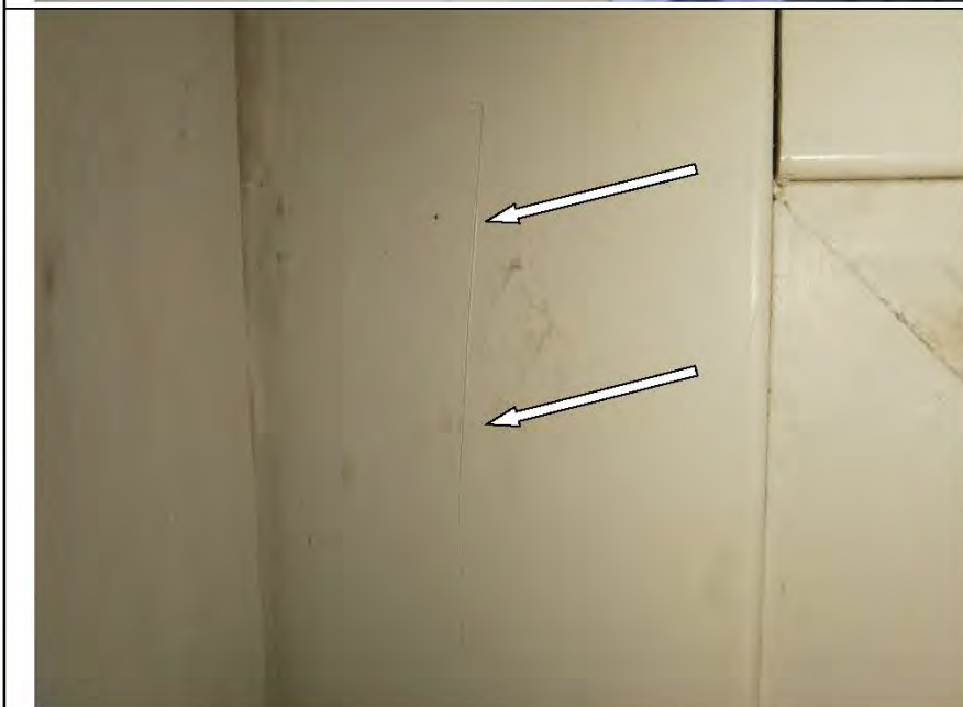
Фото №51. Царапины на профиле ПВХ оконного блока в спальне.
