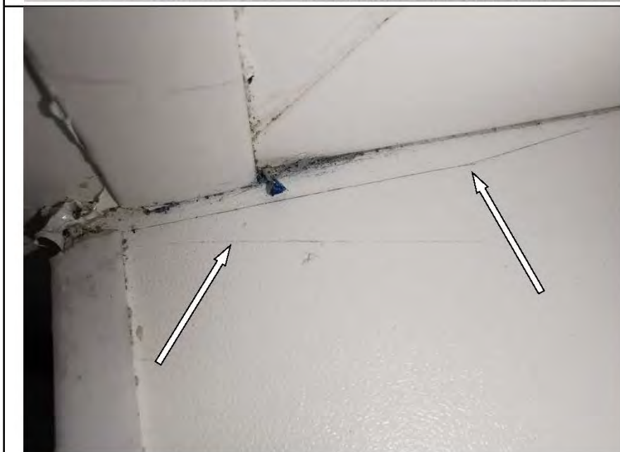
Фото №65. Царапины на лицевой поверхности подоконной доски на кухне.
