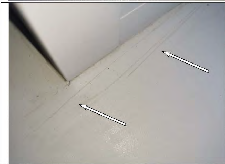
Фото №63. Царапины на лицевой поверхности подоконной доски в спальне.
