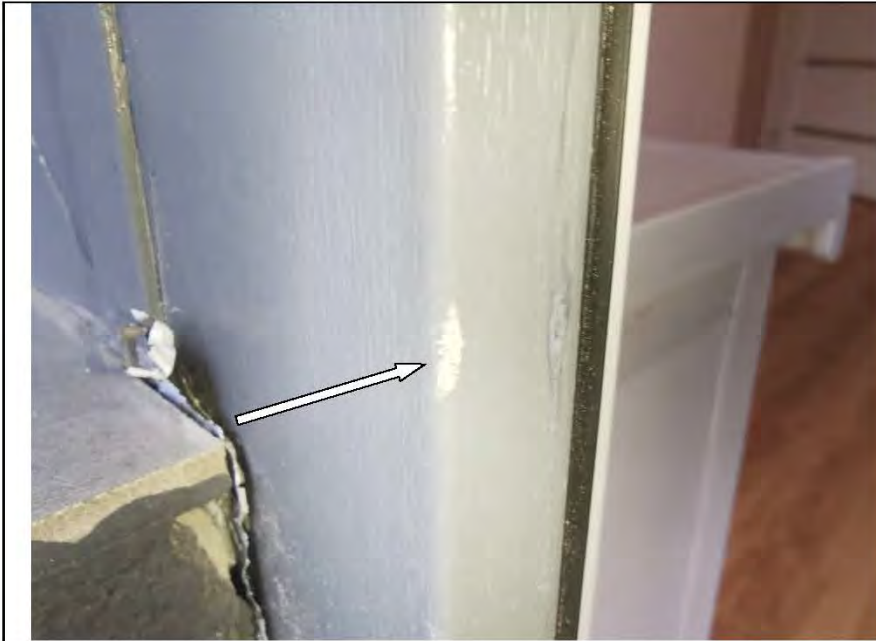
Фото №55. Потертости на профиле ПВХ дверного блока на кухне.
