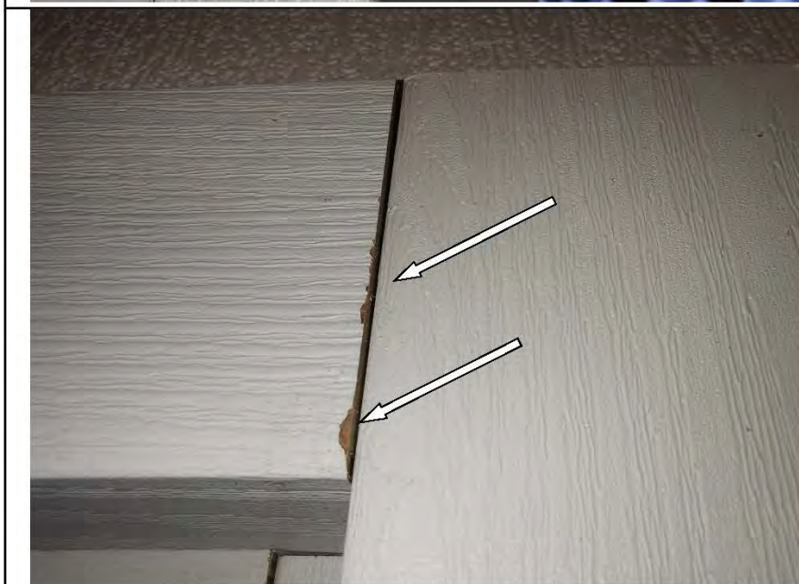
Фото №71. Потертости на наличниках деревянного дверного блока в спальне.
