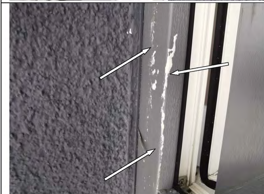
Фото №54. Потертости и загрязнения на профиле ПВХ оконного блока в детской.
