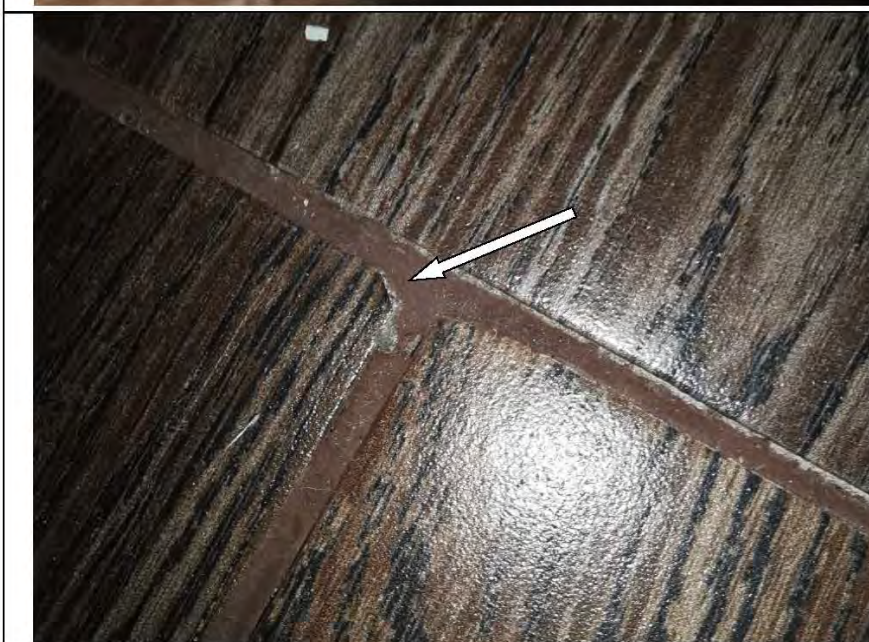
Фото №39. Напольная керамическая плитка в коридоре имеет дефекты (отбитости).
