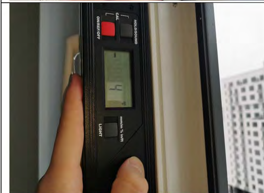
Фото №77. Отклонение ПВХ оконного блока в спальне по уровню вертикальности.
