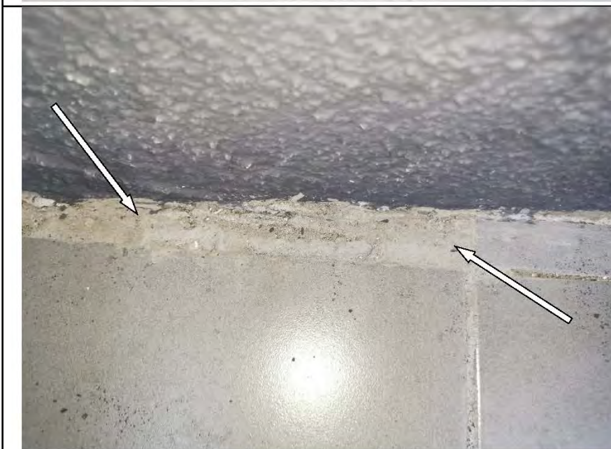
Фото №80. Затирка напольной плитки на лоджии выполнена с нарушениями (пропуски затирочного состава, неравномерное заполнение швов)
