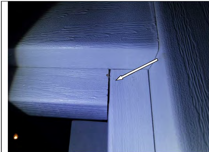
Фото №73. Ненадежное соединение элементов короба деревянного дверного блока в ванной комнате
