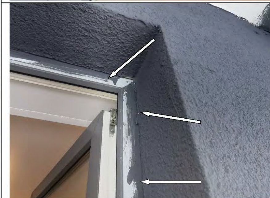
Фото №57. Загрязнения на профиле ПВХ дверного блока на кухне.
