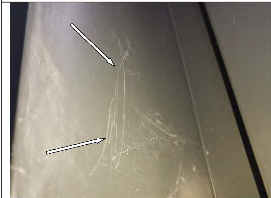
Фото №86. Дефект на металлическом профиле оконного блока на лоджии (царапины).
