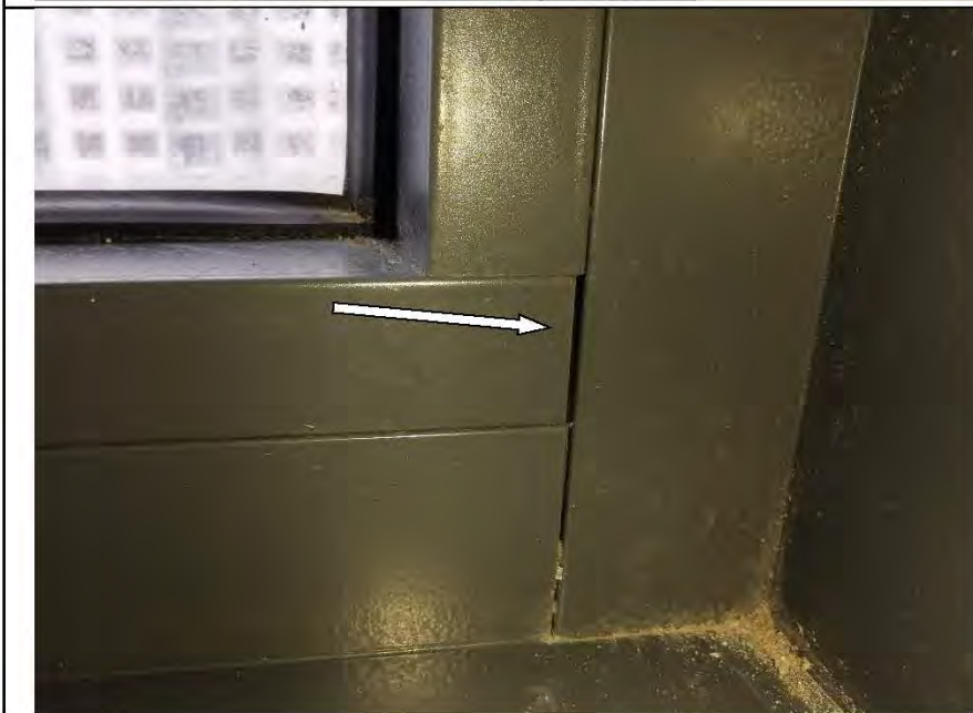
Фото №83. Дефект на металлическом профиле (зазор) оконного блока на лоджии.
