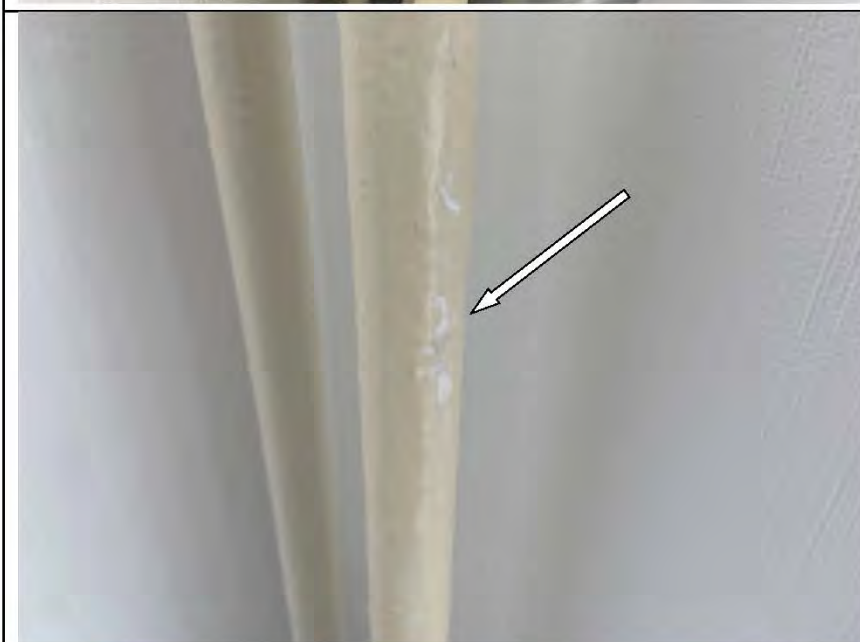
Фото №71. Неровности, подтеки на окрашенных трубах отопления в спальне.
