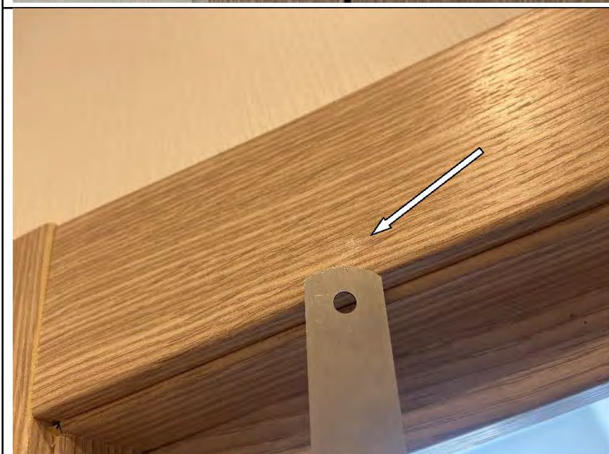
Фото №65. Загрязнения на наличнике деревянного дверного блока в спальне.
