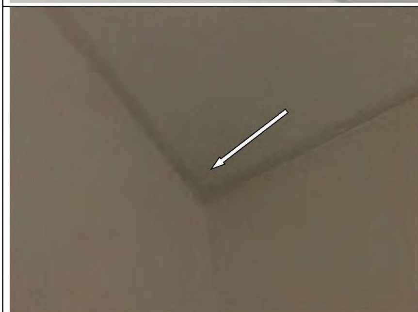
Фото №74. Загрязнения на полотне натяжного потолка в кладовке.
