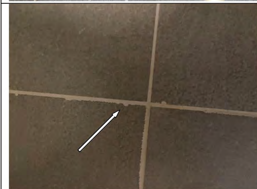
Фото №26. Загрязнения на напольной керамической плитке в кладовке.
