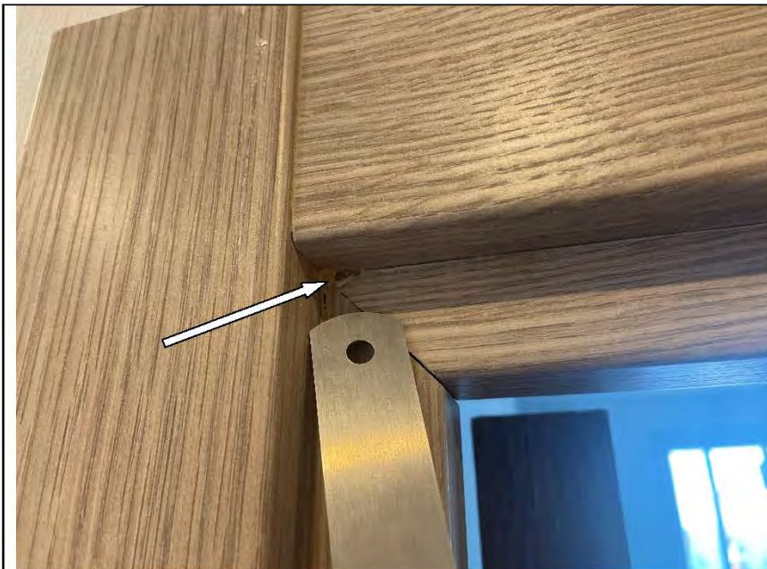
Фото №67. Загрязнения на коробке деревянного дверного блока в кухне.
