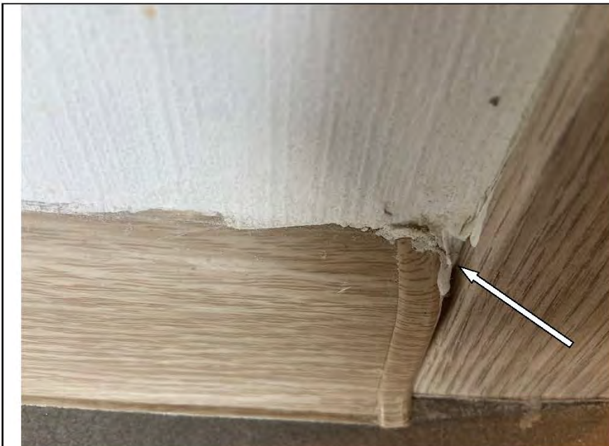
Фото №34. Загрязнения на напольном плинтусе ПВХ в кухне.
