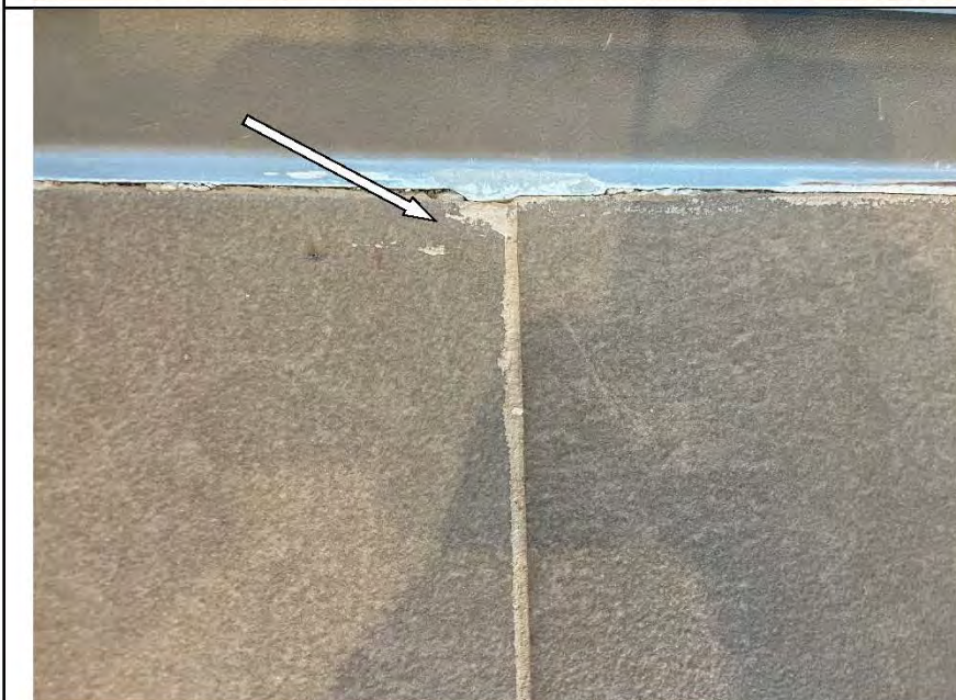
Фото №23. Загрязнения на напольной керамической плитке в коридоре.
