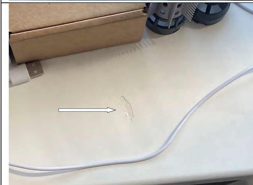
Фото №42. Механическое повреждение на лицевой стороне подоконной доски в спальне.
