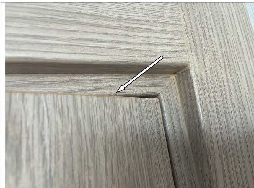
Фото №58. Загрязнения на полотне деревянного дверного блока в кухне.
