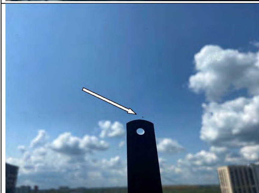
Фото №50. Окалины на стеклопакете оконного блока ПВХ на лоджии.
