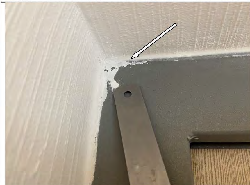
Фото №56. Загрязнения на коробке входного дверного блока в коридоре.
