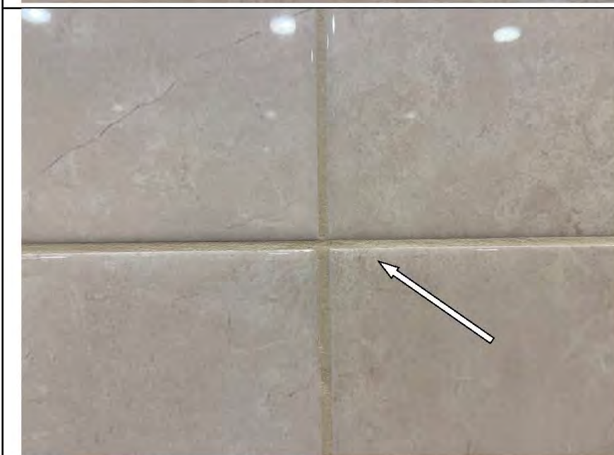
Фото №15. Неровные швы настенной керамической плитки в ванной комнате.
