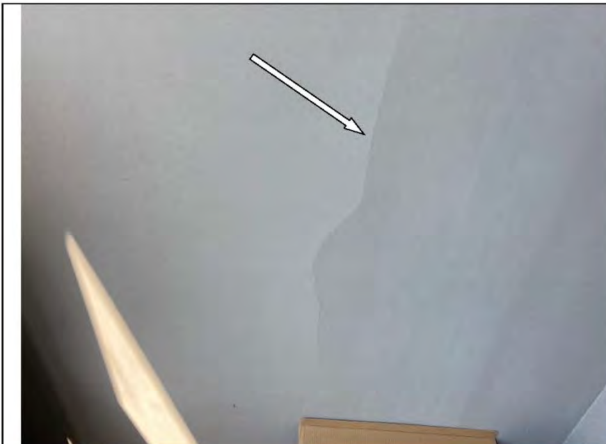
Фото №16. Трещина на окрашенной стене на лоджии.
