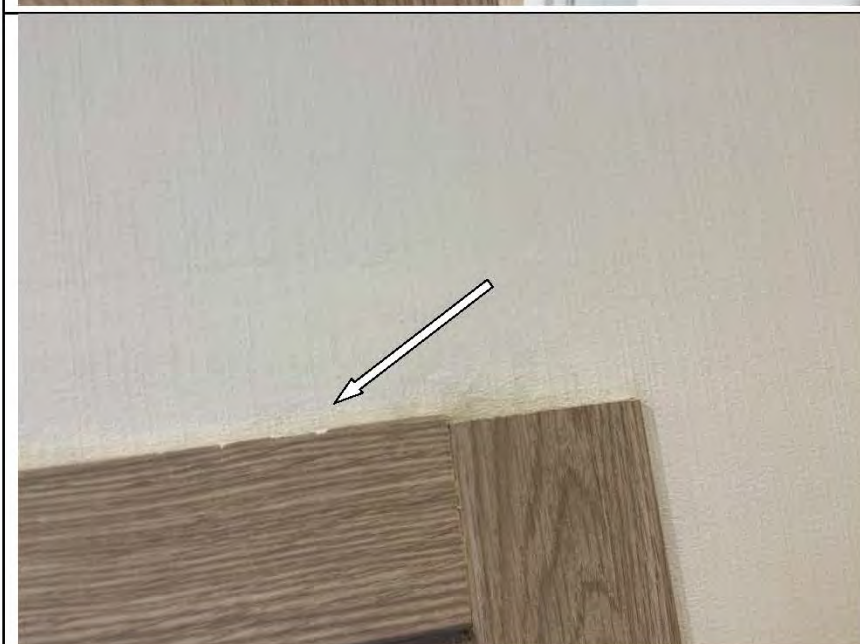
Фото №62. Загрязнения на наличнике деревянного дверного блока в ванной комнате.
