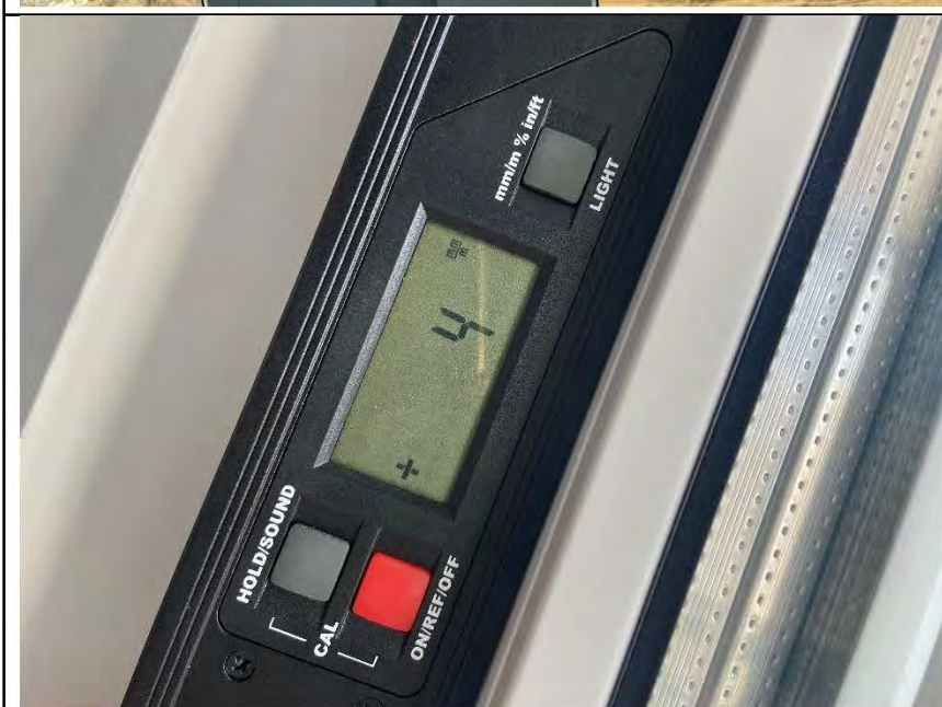
Фото №54. Отклонения поверхности по вертикали оконного блока ПВХ в кухне.
