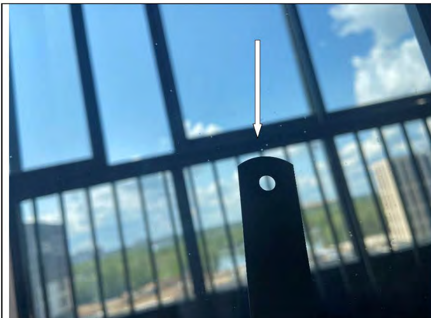
Фото №49. Окалины на стеклопакете оконного блока ПВХ в кухне.
