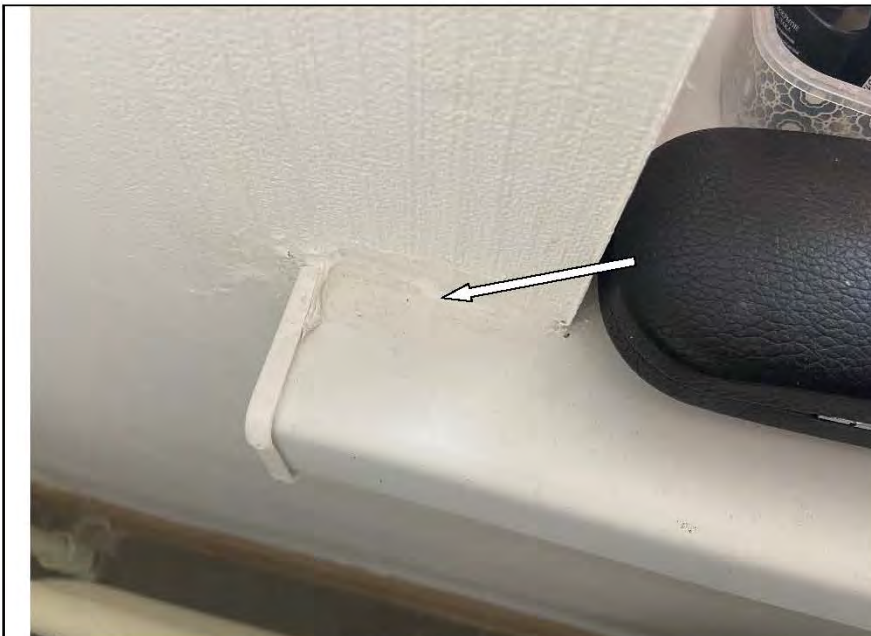
Фото №40. Загрязнения на лицевой стороне подоконной доски в кухне.
