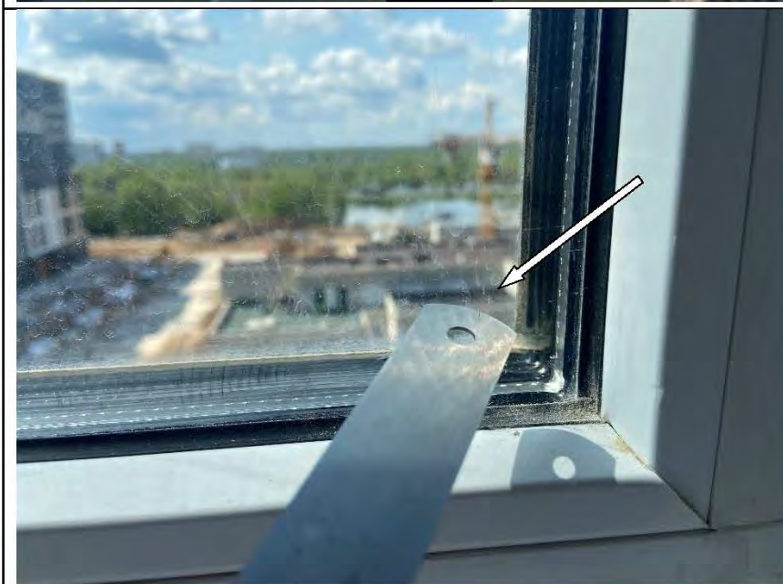
Фото №51. Царапины на стеклопакете оконного блока ПВХ в спальне.
