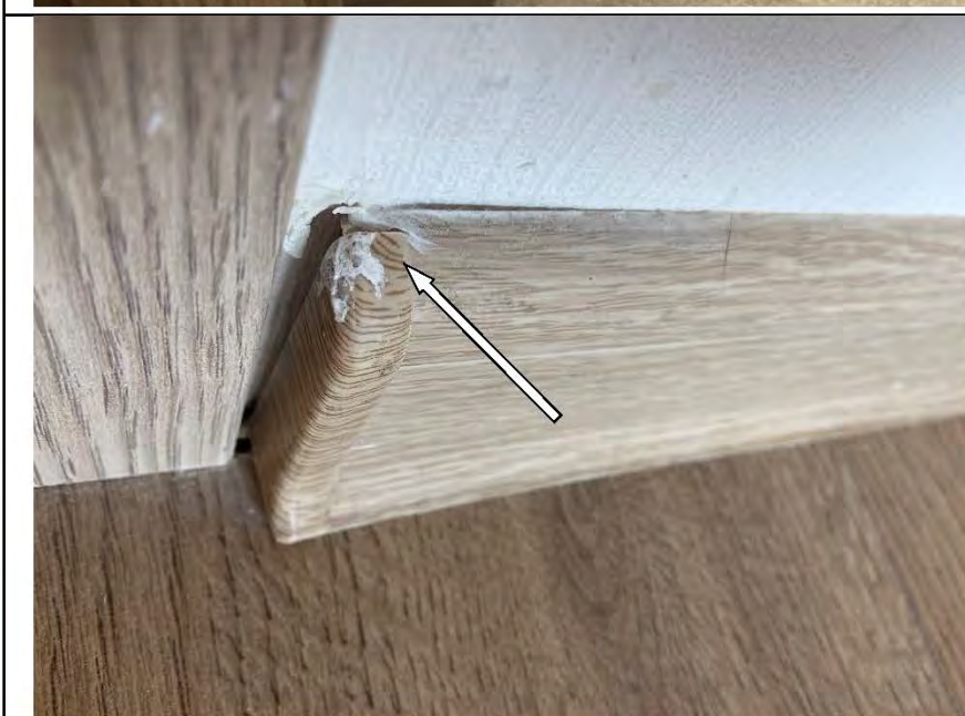
Фото №36. Загрязнения на напольном плинтусе ПВХ в спальне.
