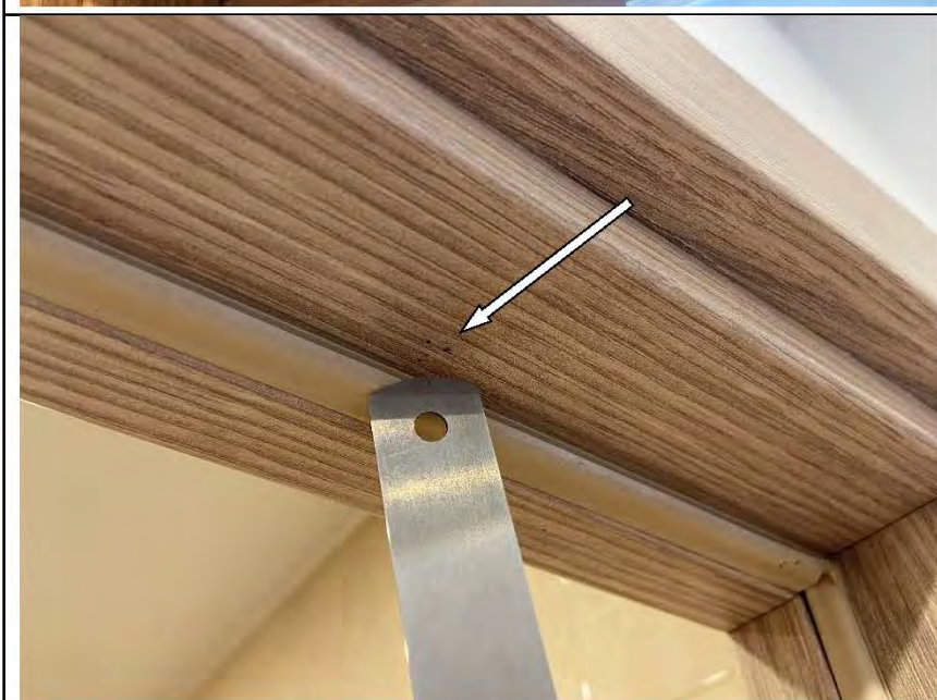
Фото №66. Загрязнения на коробке деревянного дверного блока в ванной комнате.
