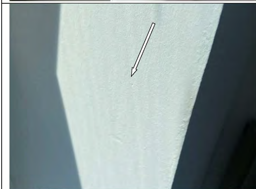
Фото №44. Неровности, выбоины на окрашенных откосах оконного блока ПВХ в спальне.
