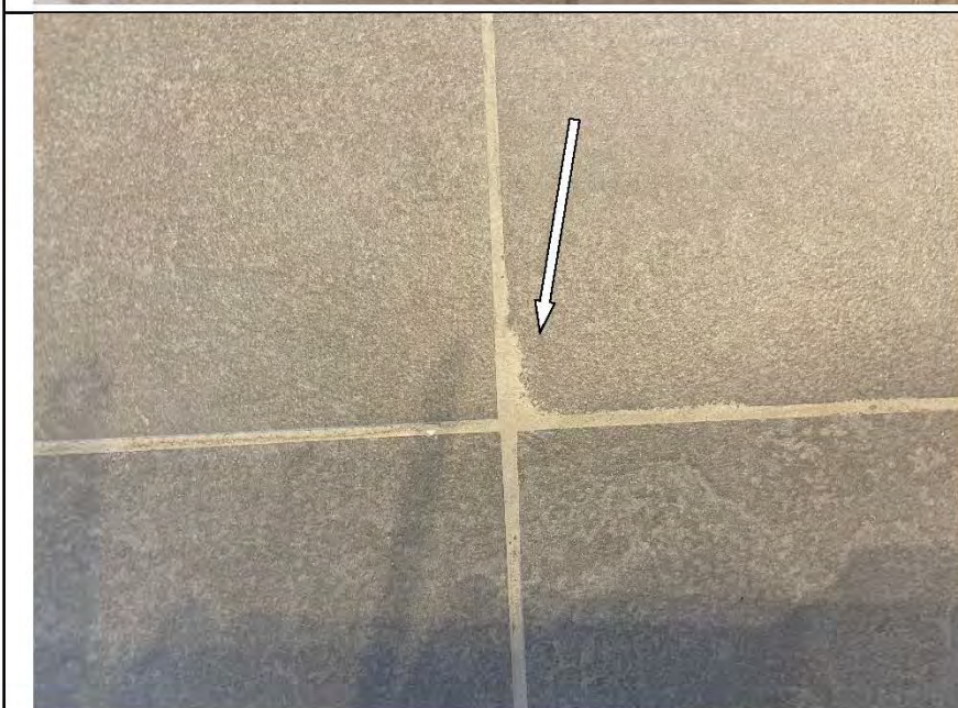
Фото №30. Неровные швы напольной керамической плитки в кухне.
