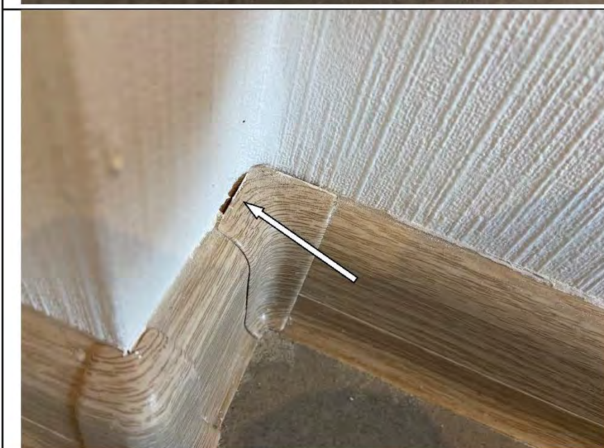
Фото №33. Загрязнения на напольном плинтусе ПВХ в коридоре.
