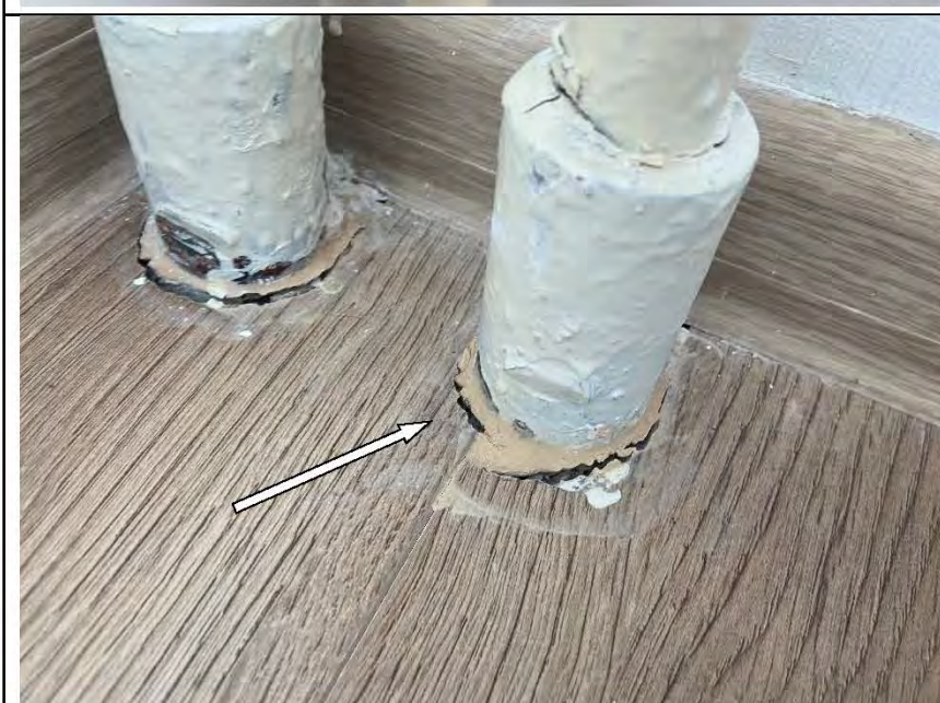
Фото №72. Дефект вставки труб отопления в напольное покрытие из ламината в спальне.
