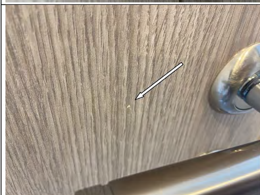
Фото №59. Загрязнения на полотне деревянного дверного блока в ванной комнате.
