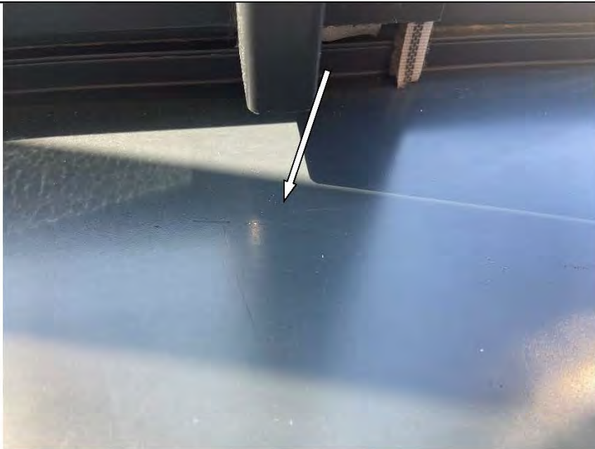
Фото №47. Дефект на алюминиевом профиле оконного блока на лоджии.
