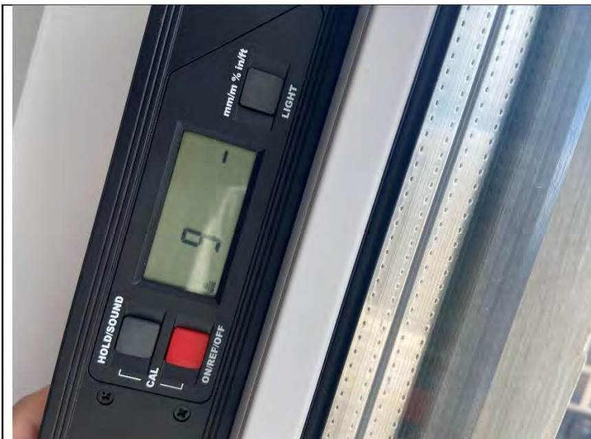
Фото №55. Отклонения поверхности по вертикали оконного блока ПВХ в спальне.
