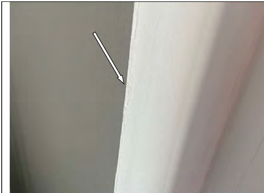
Фото №43. Неровности, выбоины на окрашенных откосах оконного блока ПВХ в кухне.
