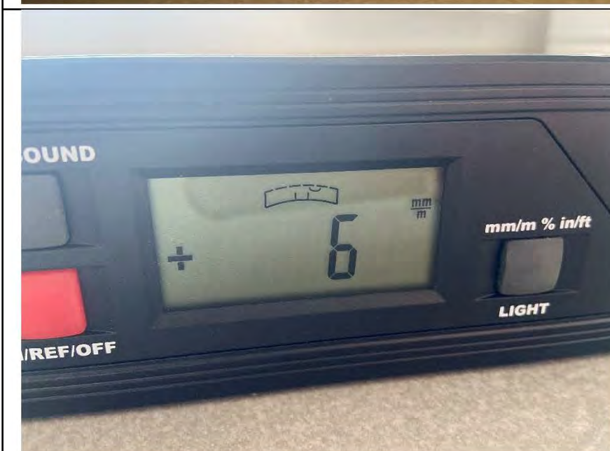
Фото №20. Отклонения напольного покрытия из керамической плитки в кухне.
