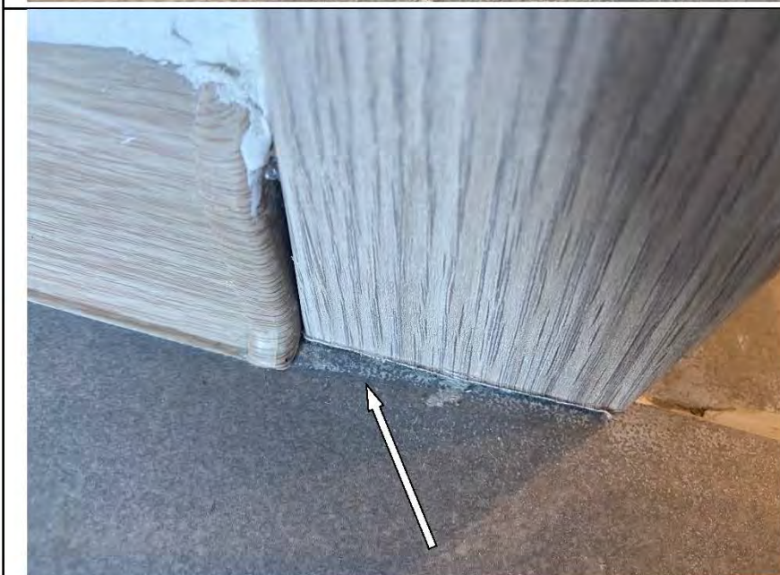
Фото №24. Загрязнения на напольной керамической плитке в кухне.
