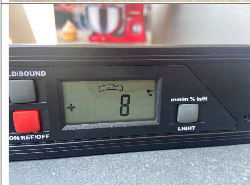
Фото №21. Отклонения напольного покрытия из керамической плитки на лоджии.
