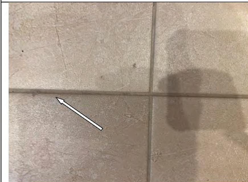
Фото №29. Неровные швы напольной керамической плитки в ванной комнате.
