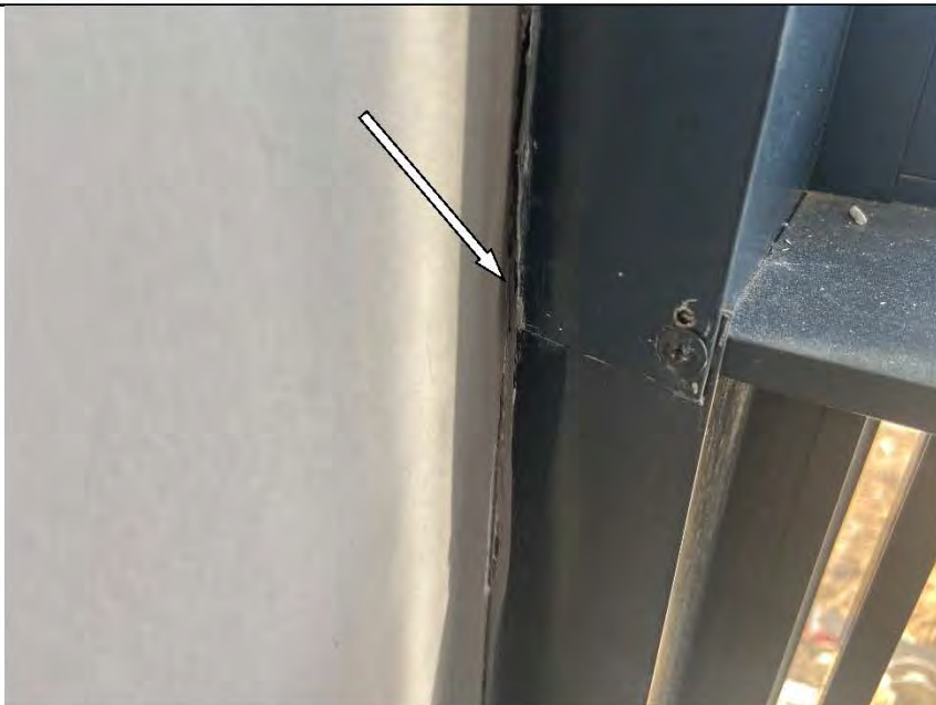
Фото №48. Дефект на алюминиевом профиле оконного блока на лоджии.
