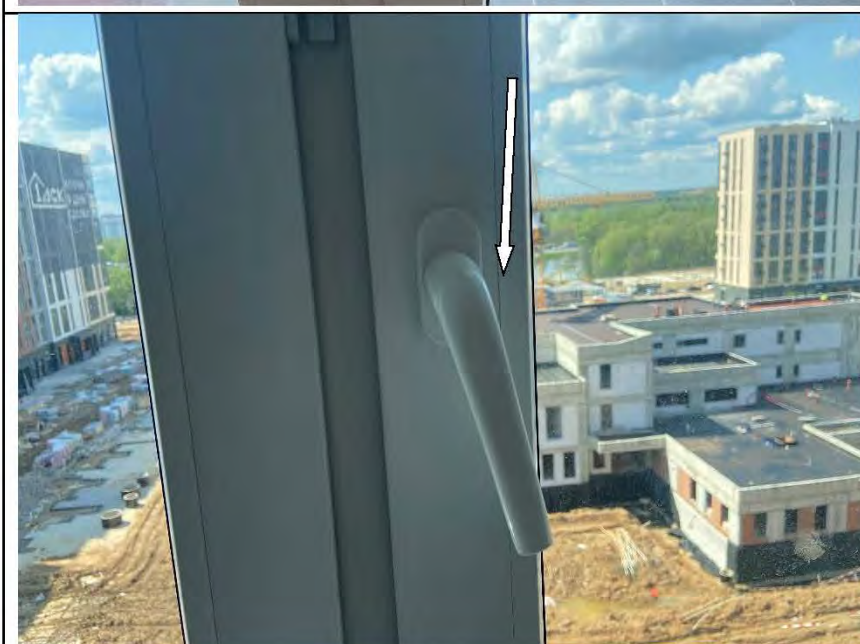
Фото №53. Не отрегулирована фурнитура оконного блока ПВХ в спальне.
