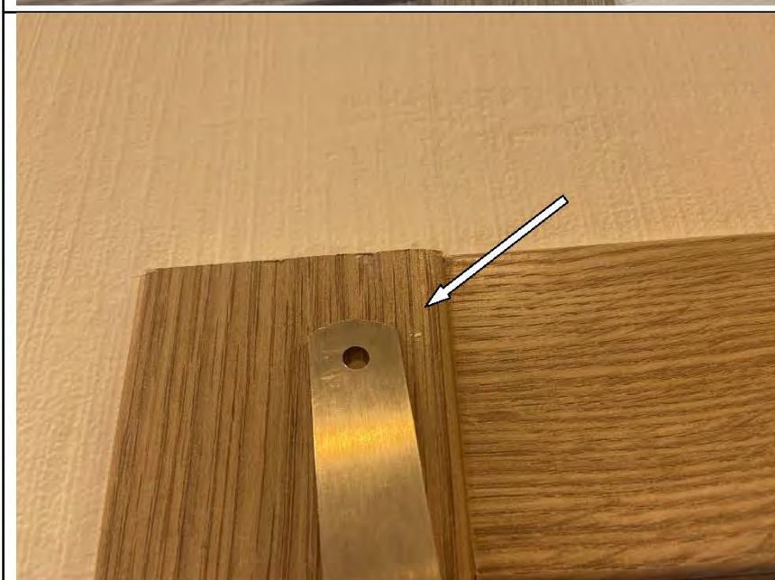
Фото №63. Загрязнения на наличнике деревянного дверного блока в кухне.
