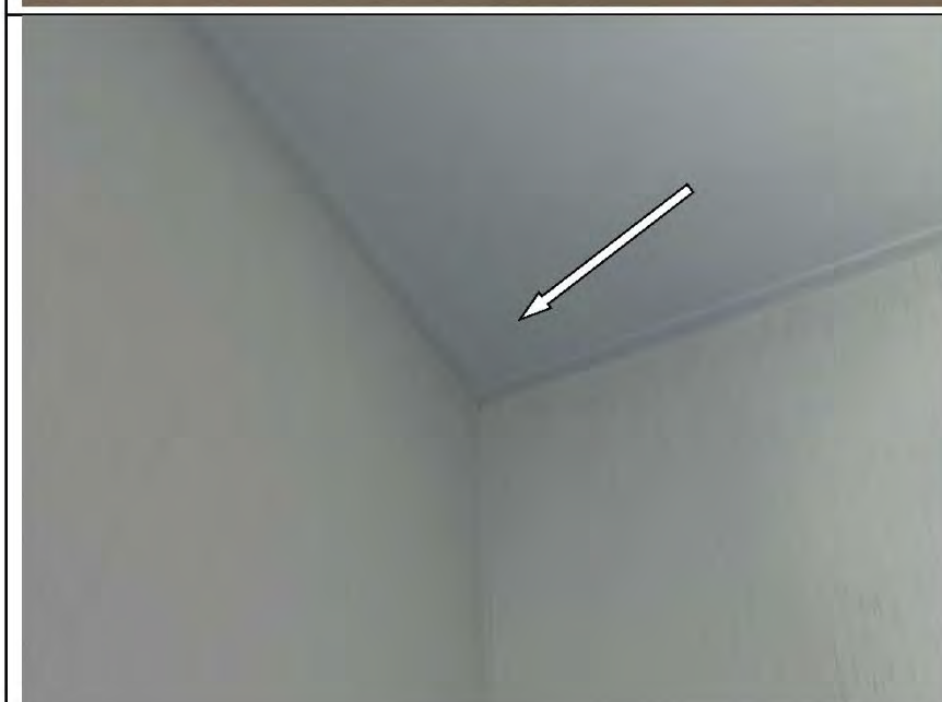
Фото №75. Загрязнения на полотне натяжного потолка в спальне.
