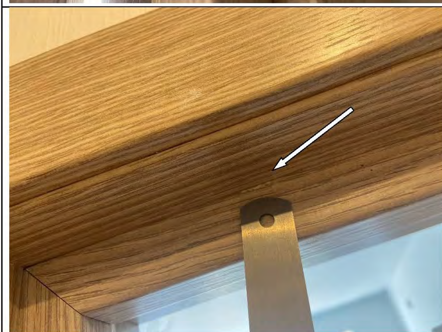
Фото №69. Загрязнения на коробке деревянного дверного блока в спальне.
