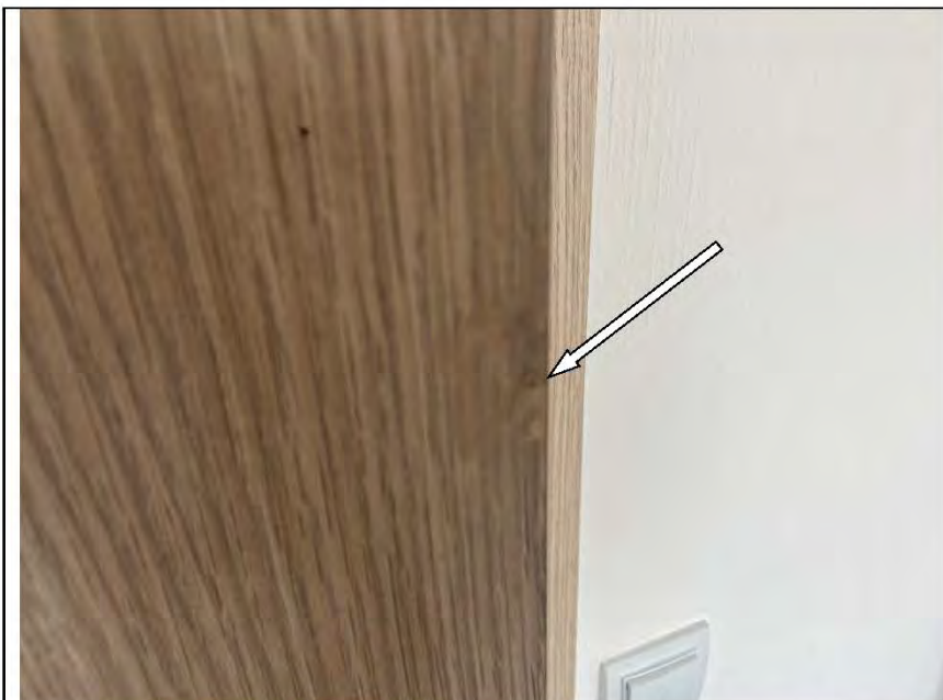
Фото №61. Загрязнения на полотне деревянного дверного блока в спальне.
