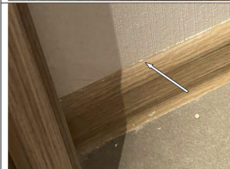
Фото №35. Загрязнения на напольном плинтусе ПВХ в кладовке.
