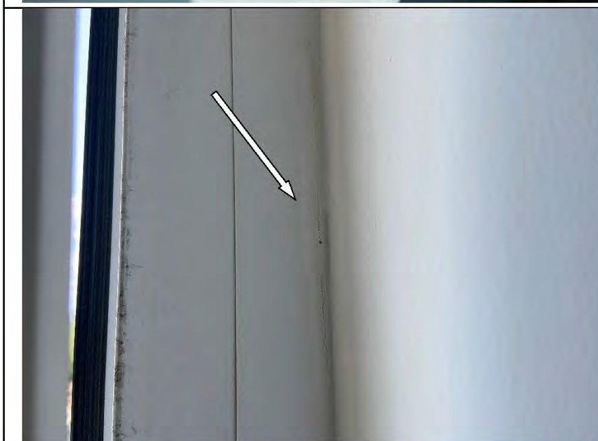
Фото №45. Загрязнения на профиле оконного блока ПВХ в спальне.
