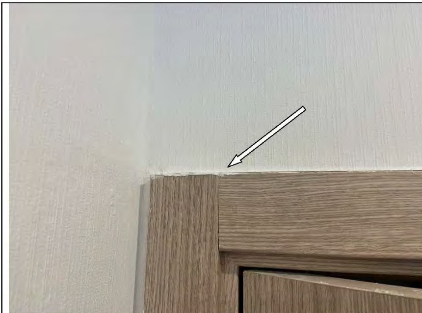
Фото №64. Загрязнения на наличнике деревянного дверного блока в кладовке.
