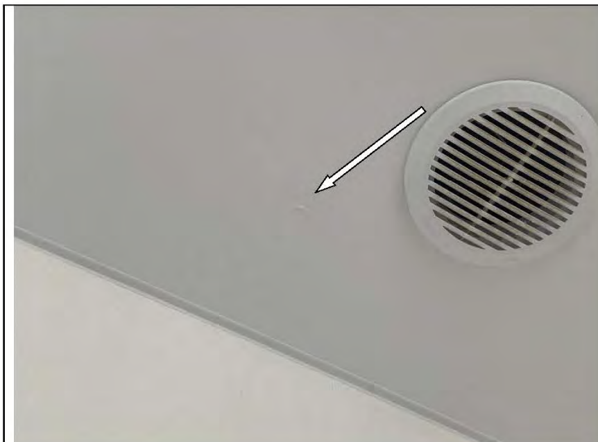
Фото №73. Загрязнения на полотне натяжного потолка в кухне.
