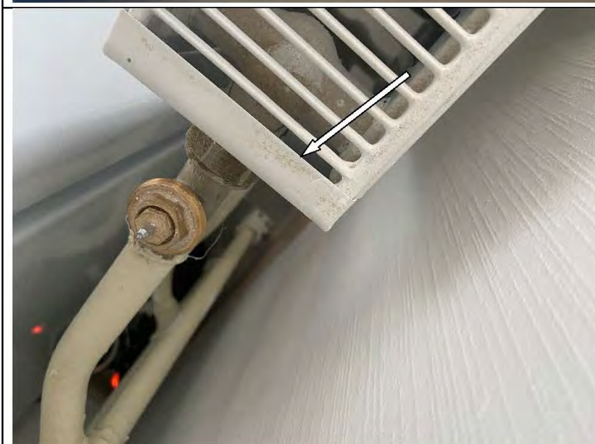
Фото №80. Загрязнения на кожухе отопительного прибора в кухне.
