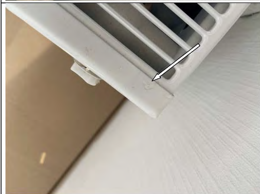
Фото №81. Загрязнения на кожухе отопительного прибора в спальне.
