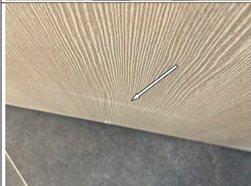
Фото №57. Загрязнения на полотне входного дверного блока в коридоре.
