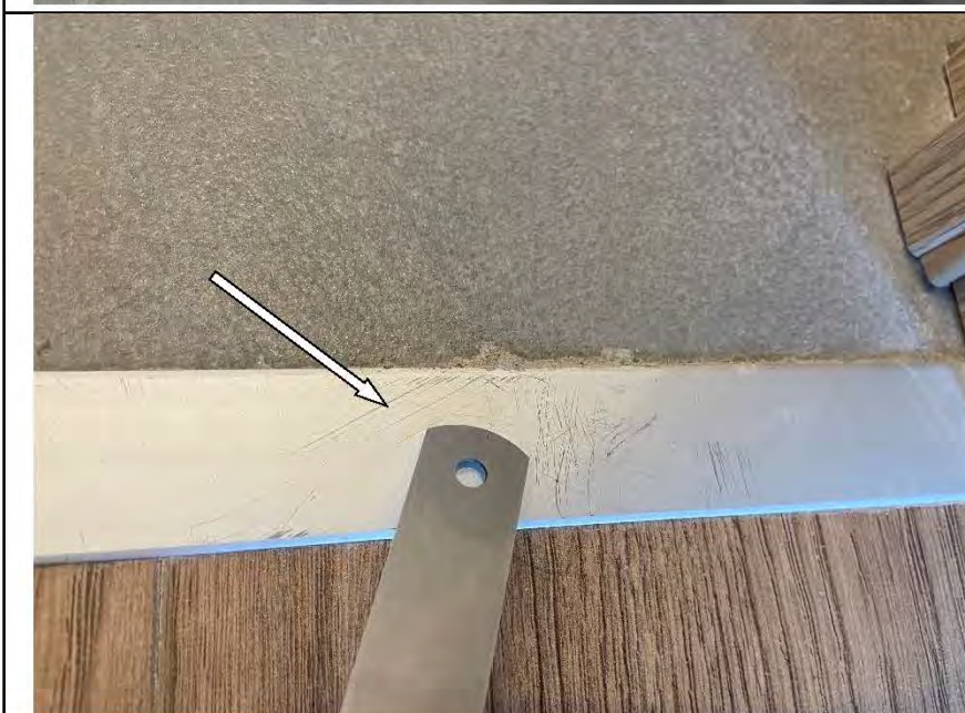
Фото №39. Царапины на напольном металлическом порошке в спальне.
