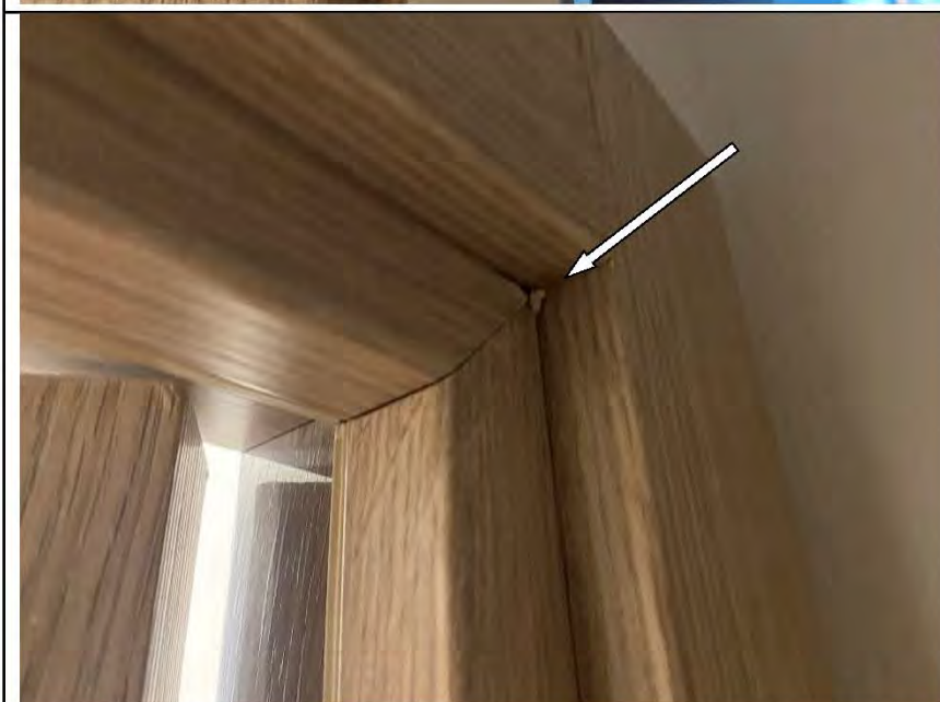
Фото №68. Загрязнения на коробке деревянного дверного блока в кладовке.
