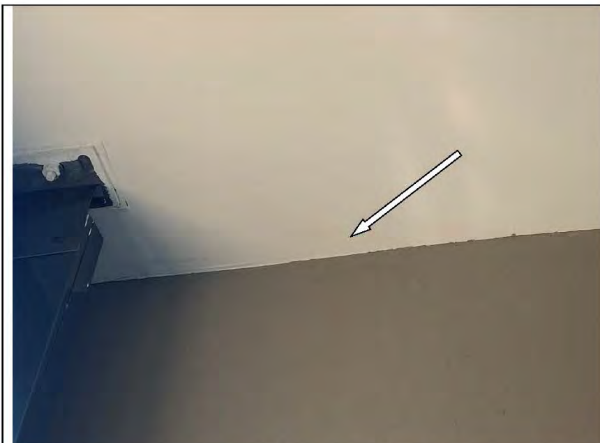
Фото №79. Неровности, выбоины, раковины на оштукатуренном потолке на лоджии.
