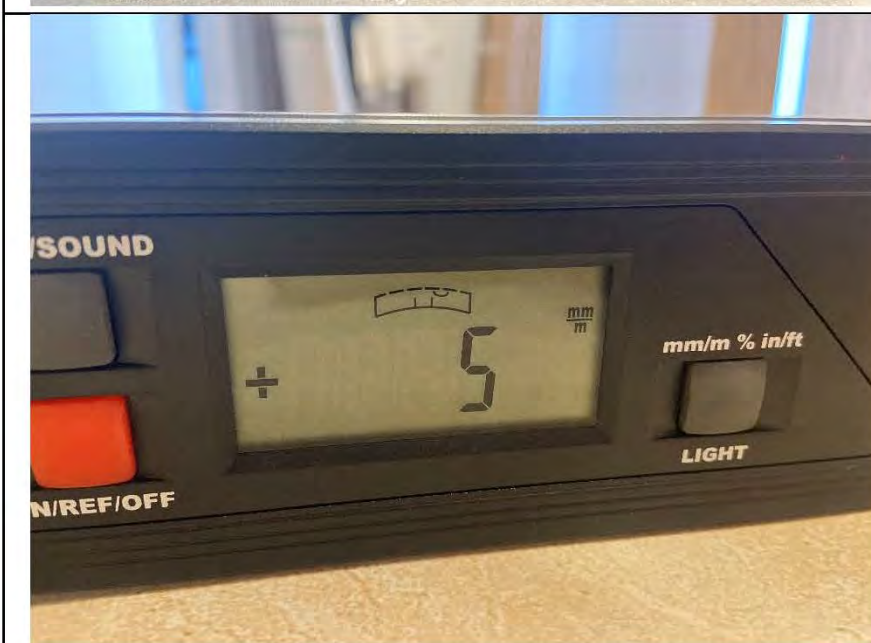
Фото №18. Отклонения напольного покрытия из керамической плитки в ванной комнате.
