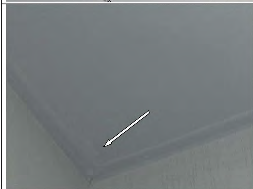
Фото №77. Загрязнения на полотне натяжного потолка в коридоре.
