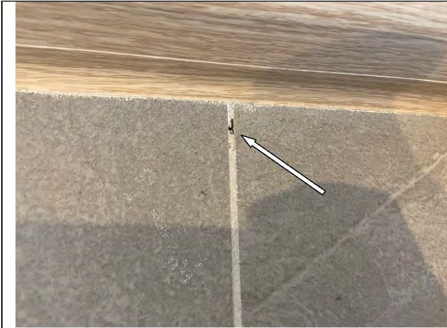
Фото №28. Неровные швы напольной керамической плитки в коридоре.
