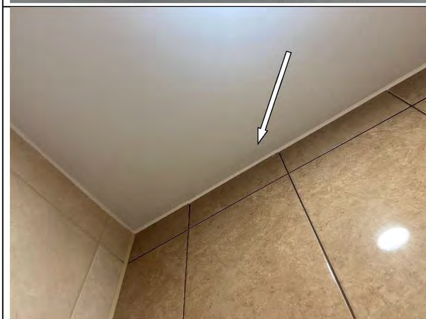
Фото №78. Неровности, загрязнения на подвесном потолке в ванной комнате.
