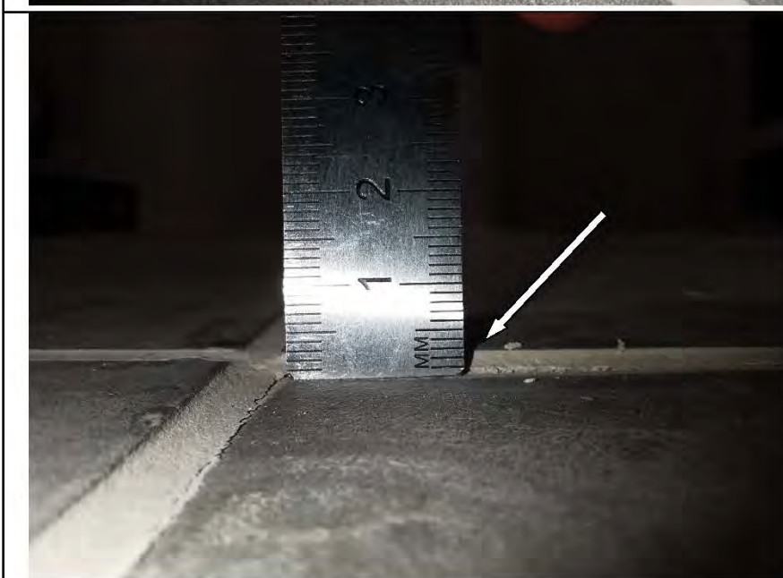
Фото №24. Уступы керамической плитки пола в ванной комнате более 1 мм.
