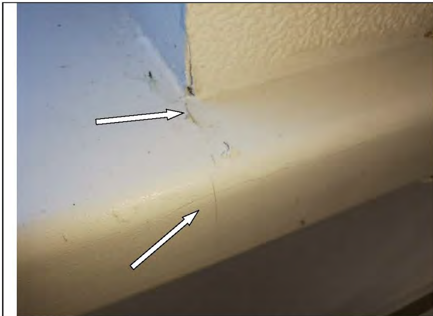
Фото №31. Царапины на лицевой поверхности подоконной доски в спальне .
