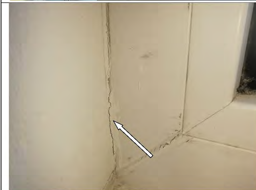
Фото №35. Окрашенные откосы оконного блока ПВХ в кухне-гостиной выполнены с дефектами.
