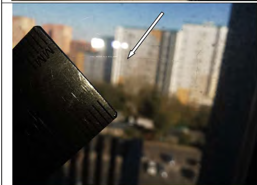
Фото №29. Царапины на стеклопакете оконного блока ПВХ в кухне-гостиной.
