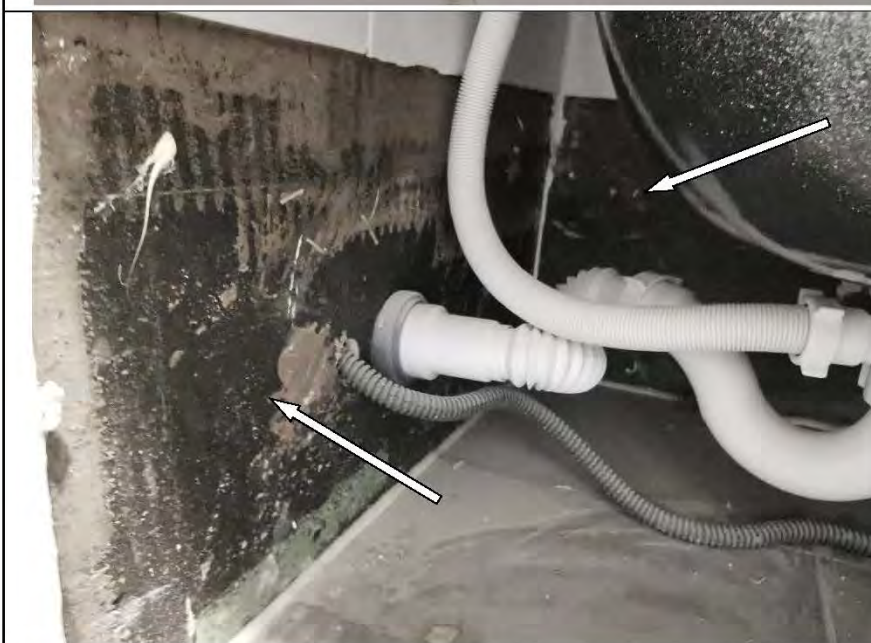
Фото №15. Частично отсутствует настенная керамическая плитка за ванной.
