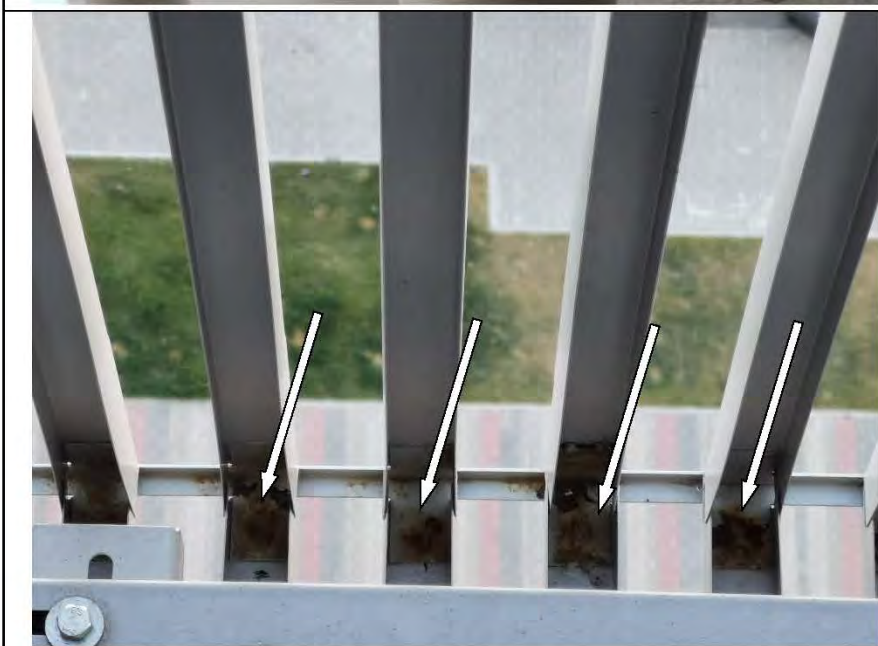
Фото №51. Коррозия на коробе для установки кондиционера в кухне-гостиной.
