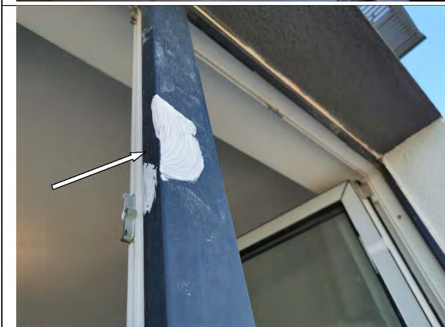
Фото №27. Загрязнение профилей ПВХ оконного блока в спальне.
