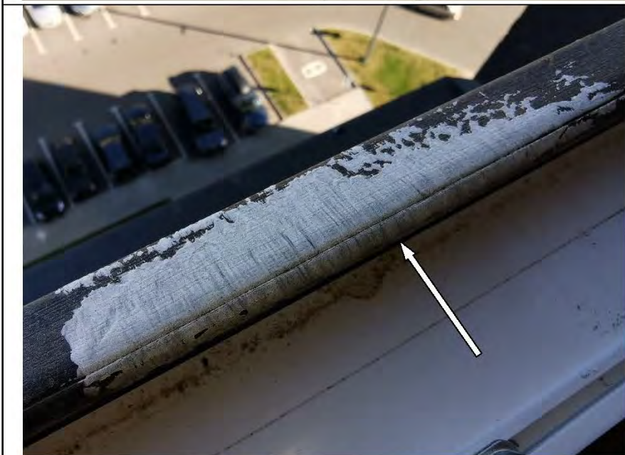
Фото №26. Загрязнение профилей ПВХ оконного блока в спальне.
