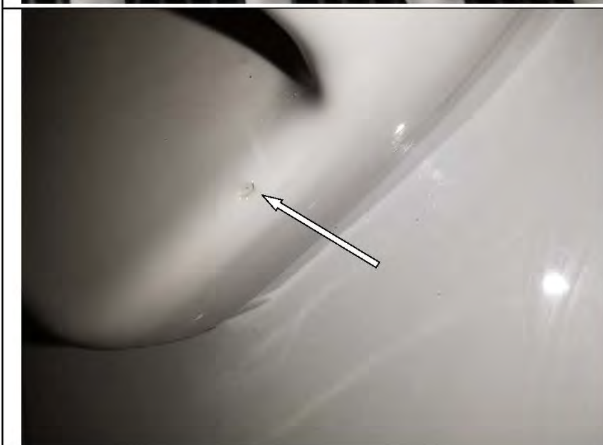
Фото №48. Откол на унитазе в ванной комнате.
