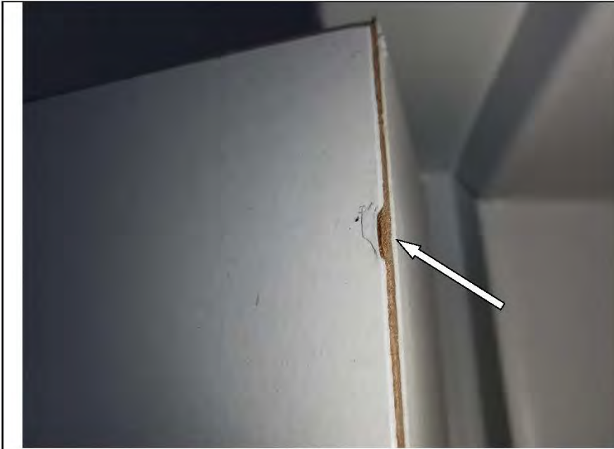
Фото №40. Повреждение ламинации полотна деревянного дверного блока в спальне.
