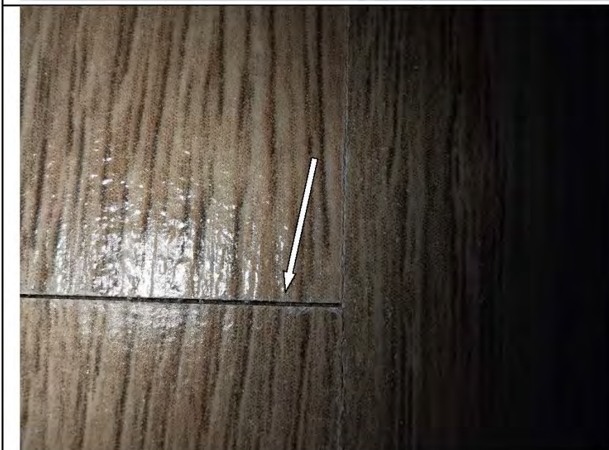
Фото №21. Зазор между соседними досками ламината в спальне.
