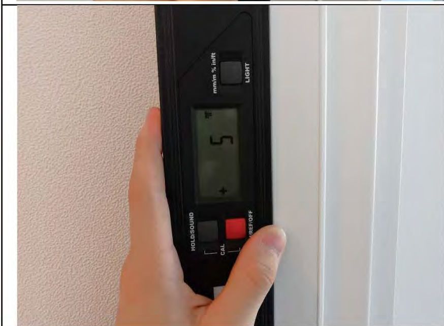
Фото №42. Отклонение коробки дверного блока от уровня вертикальности в спальне.
