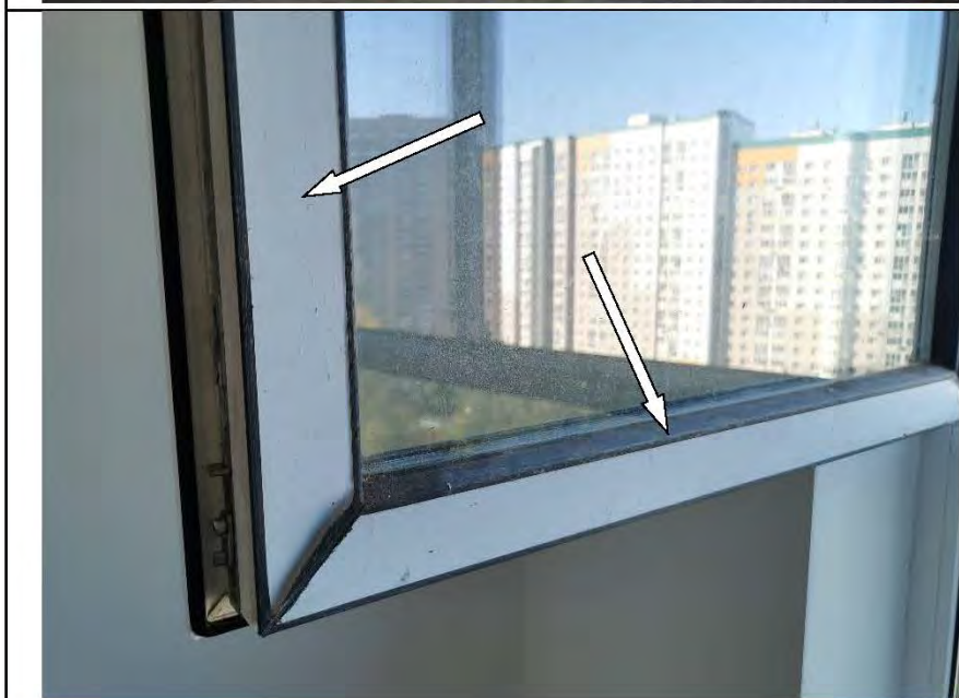
Фото №33. Не удалена защитная пленка с лицевой поверхности профилей оконного блока в спальне.
