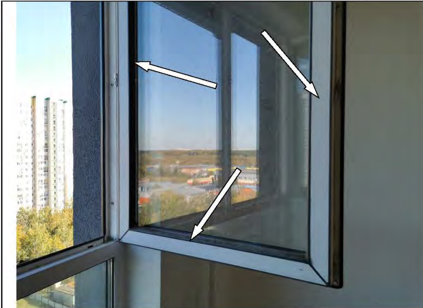
Фото №34. Не удалена защитная пленка с лицевой поверхности профилей оконного блока в кухне-гостиной.
