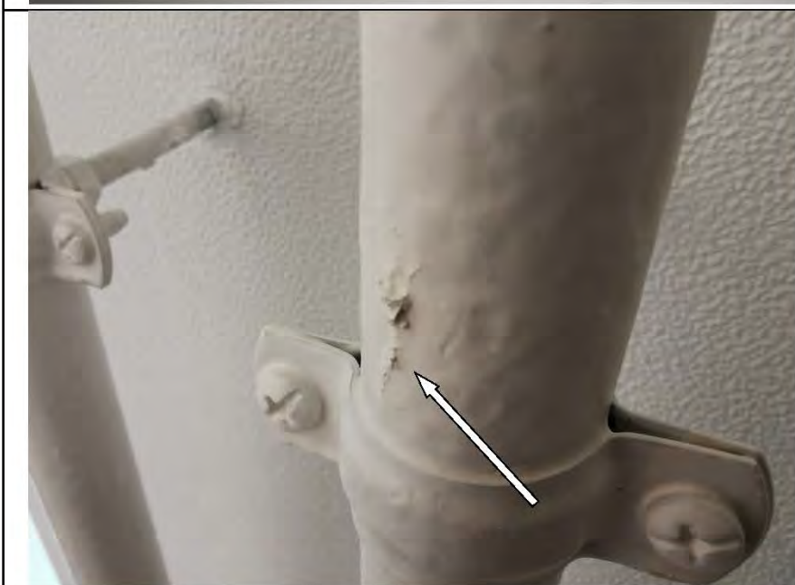
Фото №50. Окрашивание труб отопления в спальне выполнено с дефектами.
