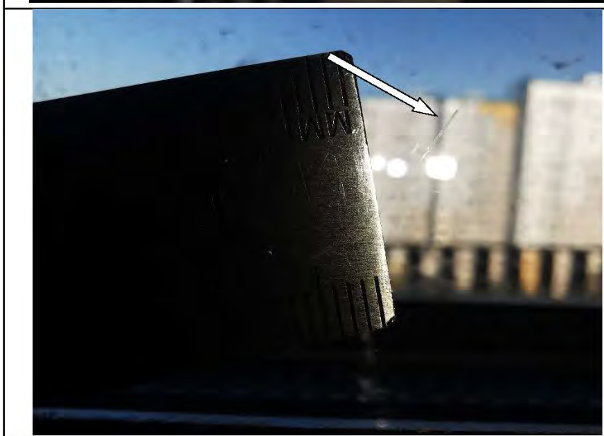
Фото №30. Царапины на стеклопакете оконного блока ПВХ в кухне-гостиной.
