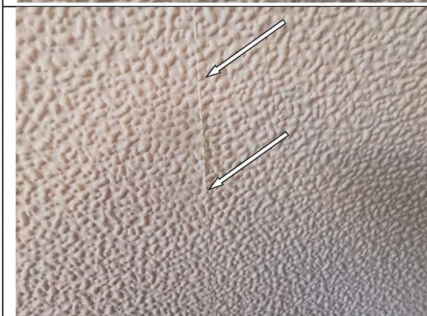
Фото №12. Читаемые обойные стыки в спальне.
