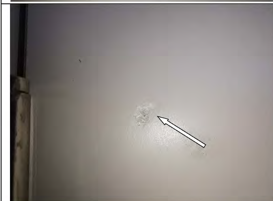
Фото №39. Потертости на полотне деревянного дверного блока в спальне.
