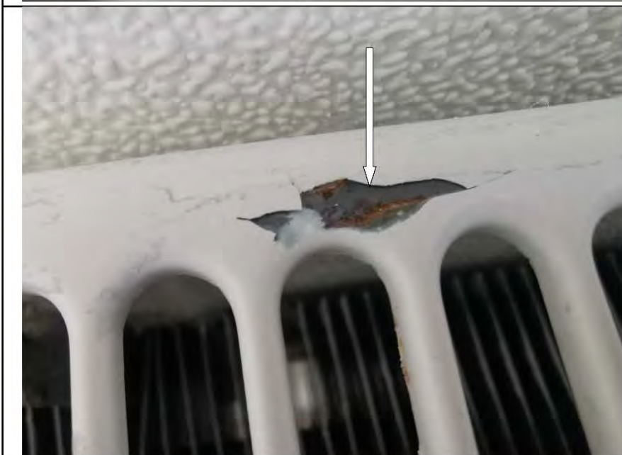
Фото №47. Коррозия на радиаторе в кухне-гостиной.
