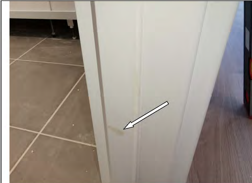
Фото №37. Загрязнение короба деревянного дверного блока в ванной комнате.
