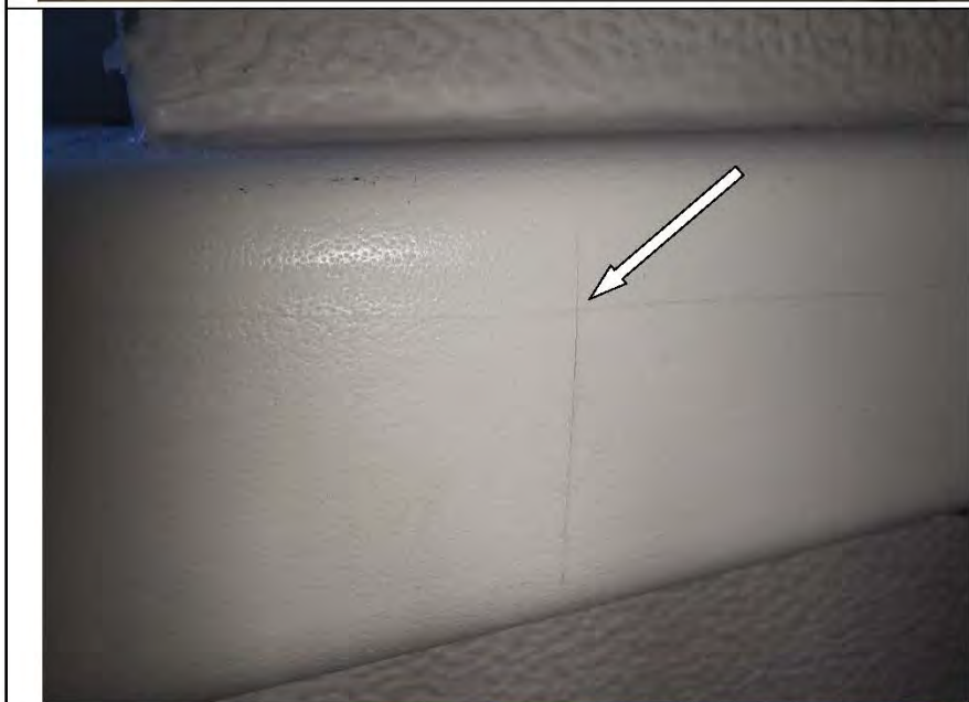
Фото №32. Царапины на лицевой поверхности подоконной доски в кухне-гостиной.
