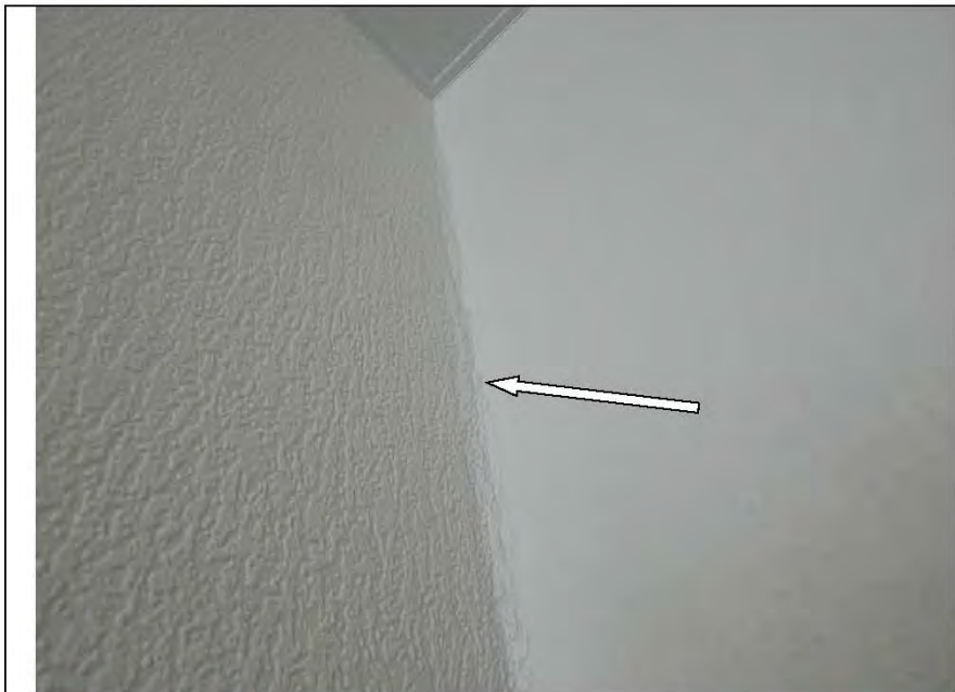
Фото №16. Отслоение обойного полотна в кухне.
