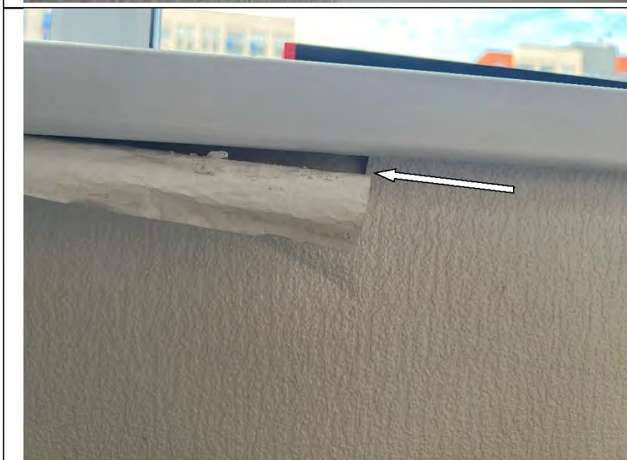
Фото №17. Отслоение обойного полотна в спальне.
