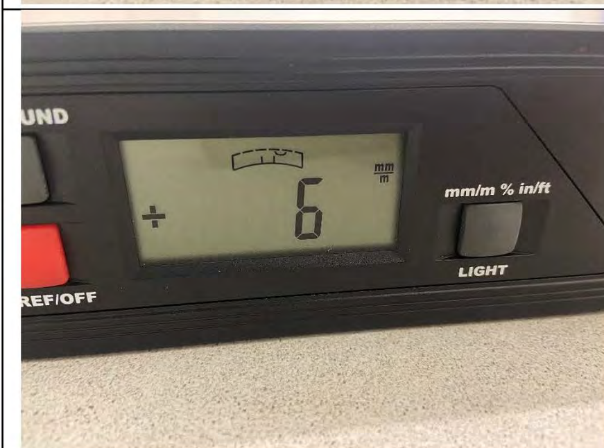
Фото №24. Отклонение напольного покрытия из керамической плитки в санузле.
