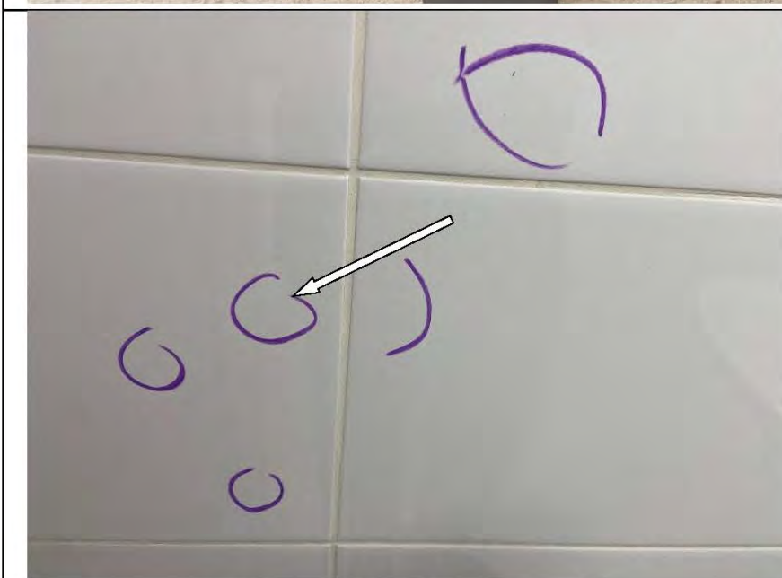
Фото №41. Окарины на настенной керамической плитке в санузле.
