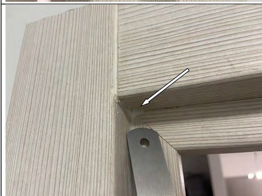
Фото №77. Дефект на коробке деревянного дверного блока в ванной комнате.
