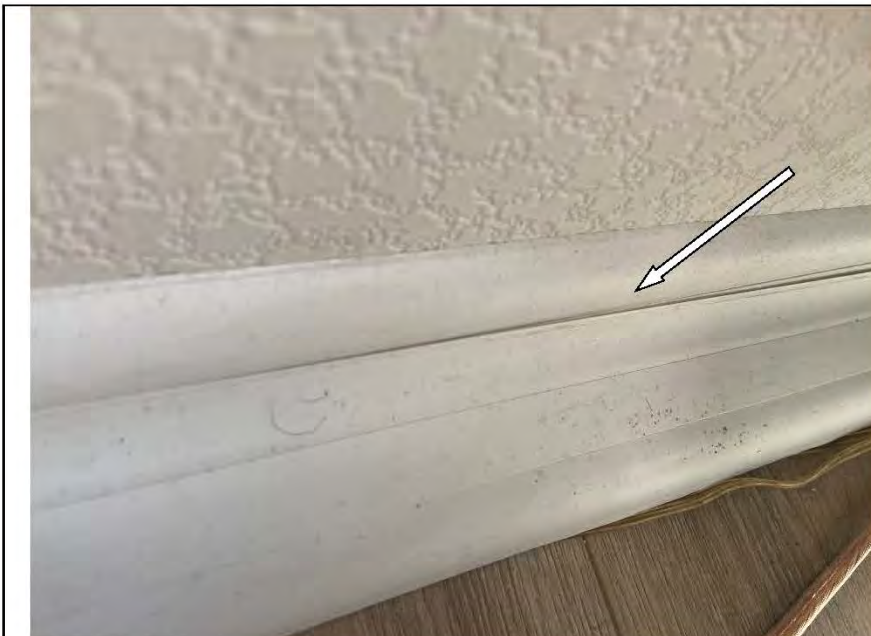
Фото №37. Дефект на напольном плинтусе ПВХ в кухне.
