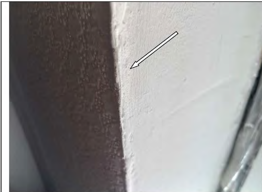
Фото №46. Неровности, выбоины, раковины на окрашенных откосах оконного блока ПВХ в кабинете.
