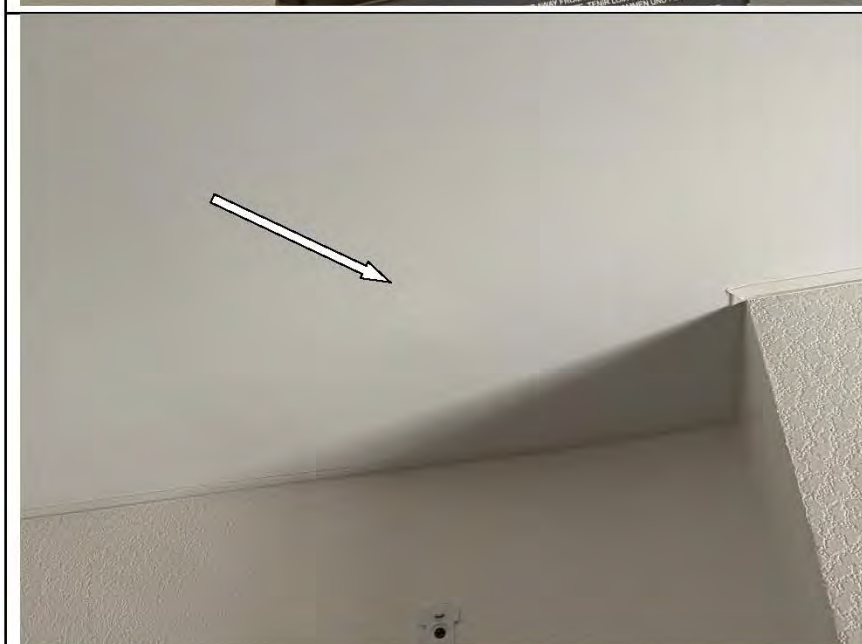
Фото №83. Загрязнения на полотне натяжного потолка в спальне.
