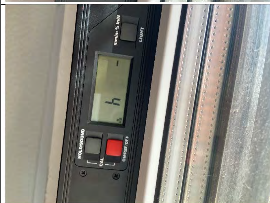
Фото №60. Отклонения по вертикали оконного блока ПВХ в кабинете.
