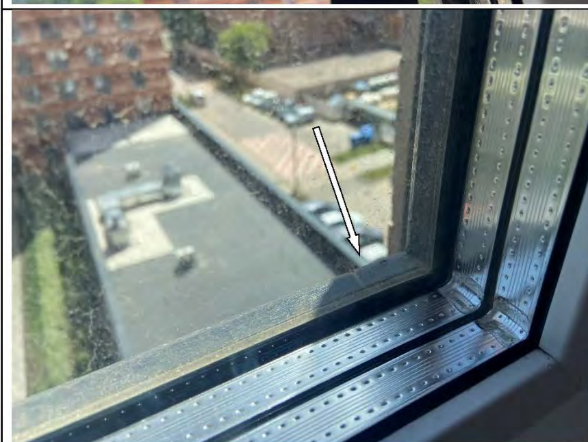
Фото №54. Царапина на стеклопакете оконного блока ПВХ в спальне.
