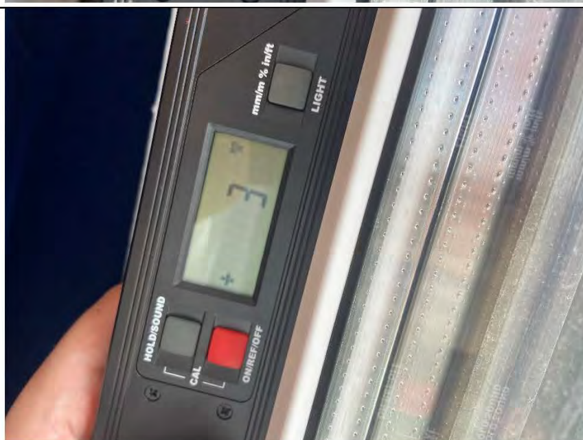
Фото №62. Отклонения по вертикали оконного блока ПВХ в кухне.
