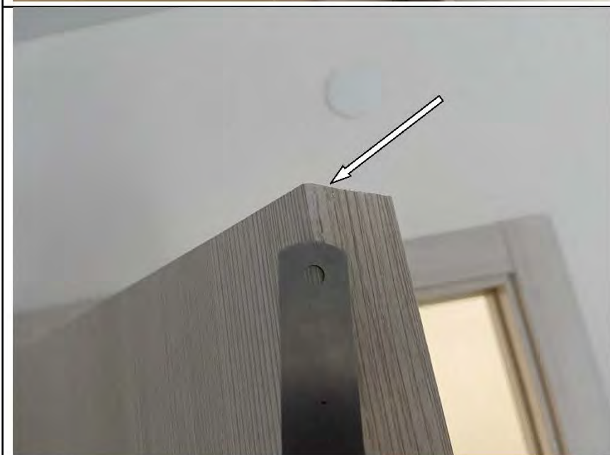
Фото №66. Загрязнения на полотне деревянного дверного блока в спальне.
