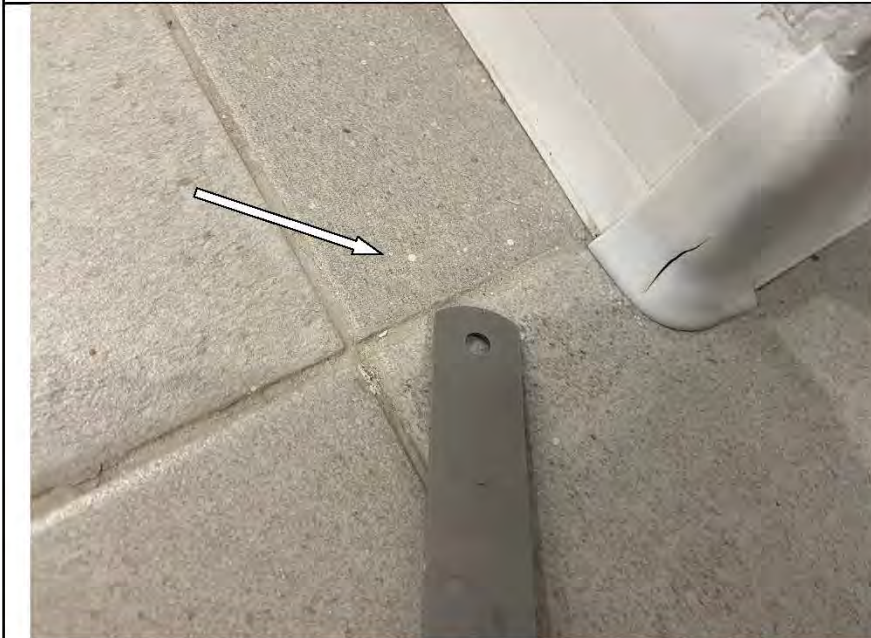
Фото №29. Загрязнения на напольной керамической плитке в кухне.
