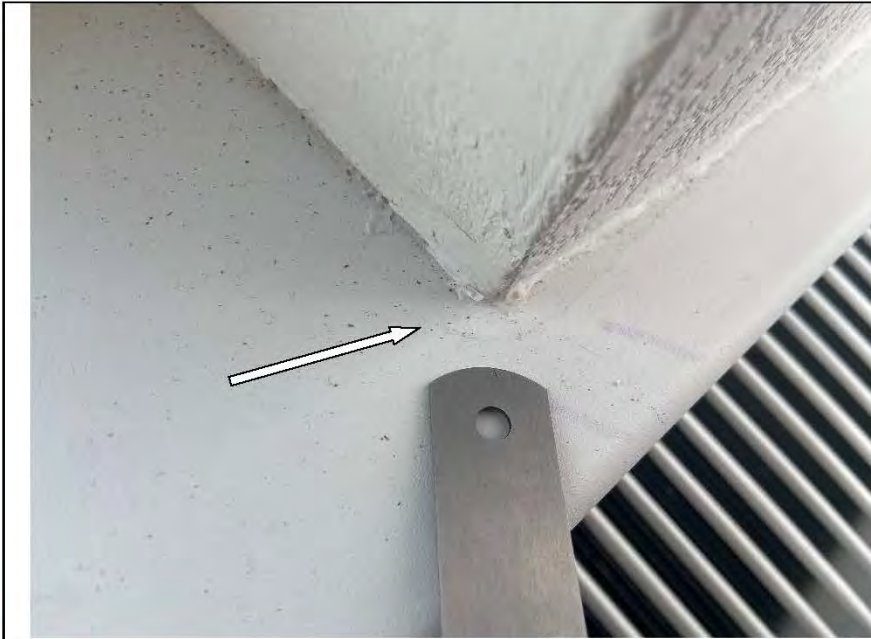
Фото №43. Дефект на лицевой стороне подоконной доски в кабинете.
