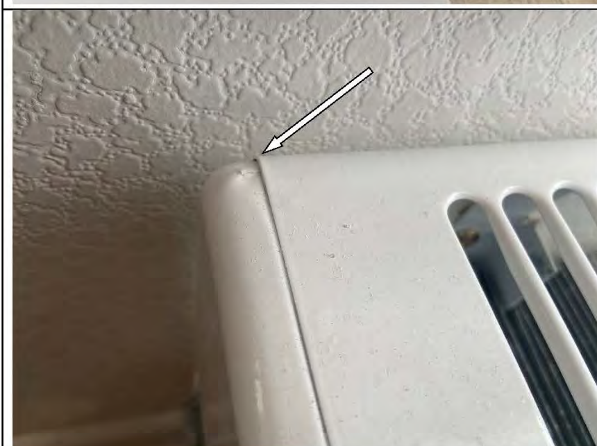
Фото №90. Загиб на металлическом кожухе отопительного прибора в кабинете.
