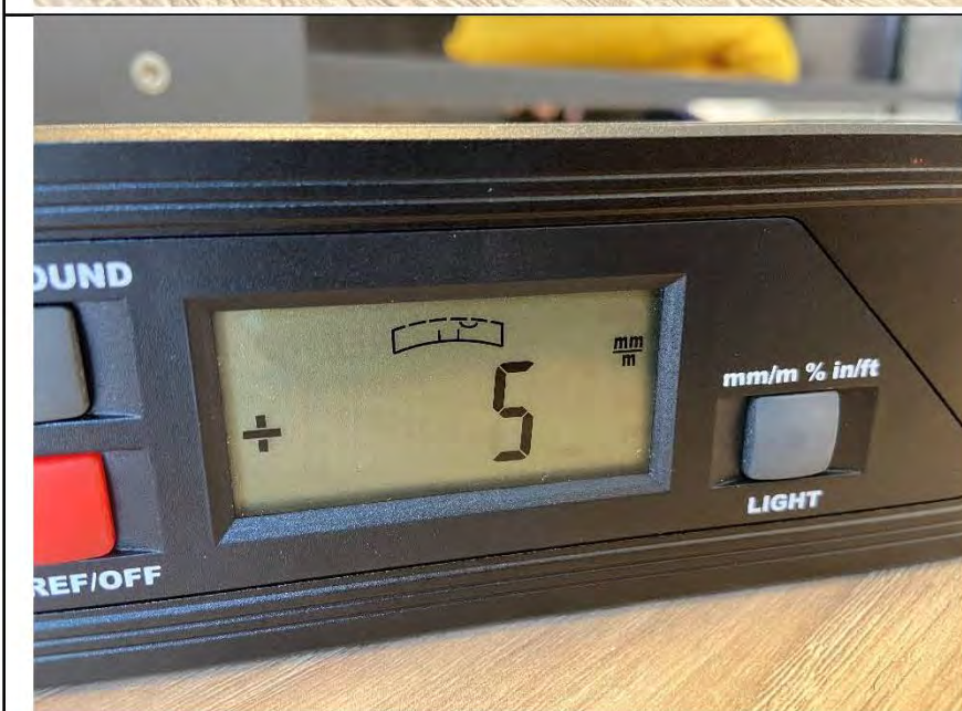
Фото №21. Отклонение напольного покрытия из ламината в кухне.
