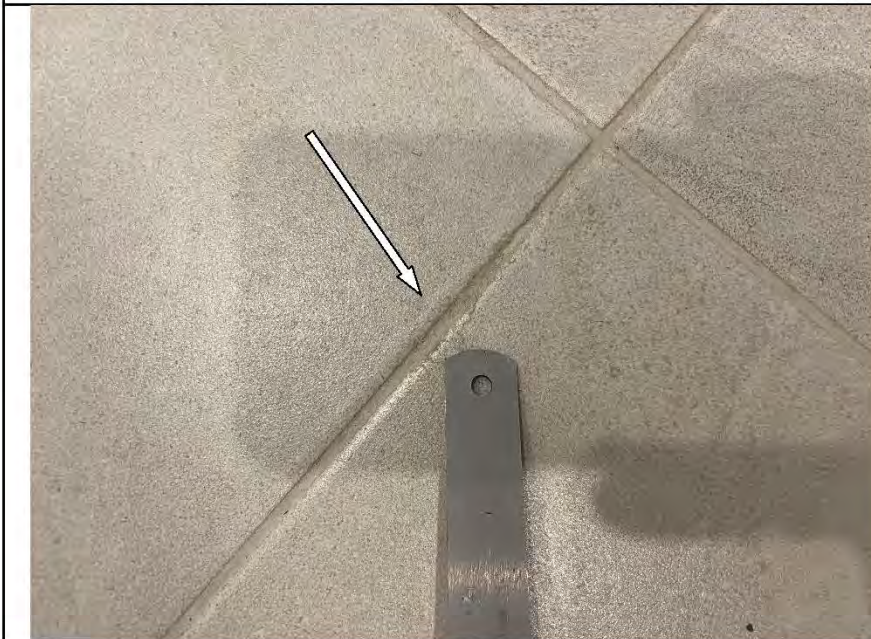
Фото №30. Неровные швы напольной керамической плитки в коридоре.
