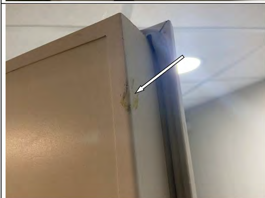
Фото №65. Загрязнения на полотне входного дверного блока в коридоре.
