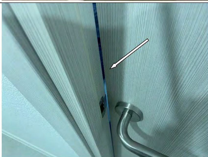
Фото №80. Не закрывается/открывается свободно дверь в спальне.
