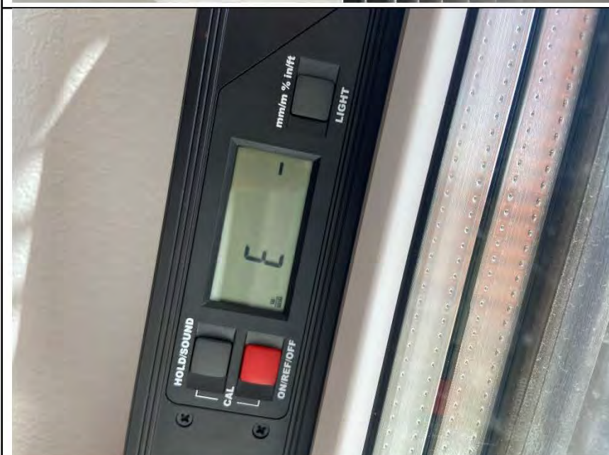
Фото №59. Отклонения по вертикали оконного блока ПВХ в спальне.
