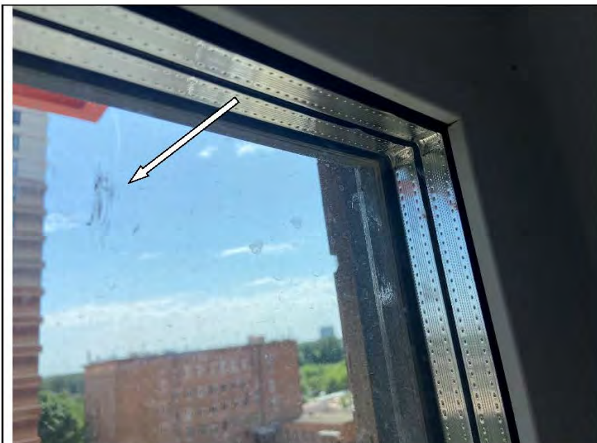
Фото №55. Царапина на стеклопакете оконного блока ПВХ в кухне.
