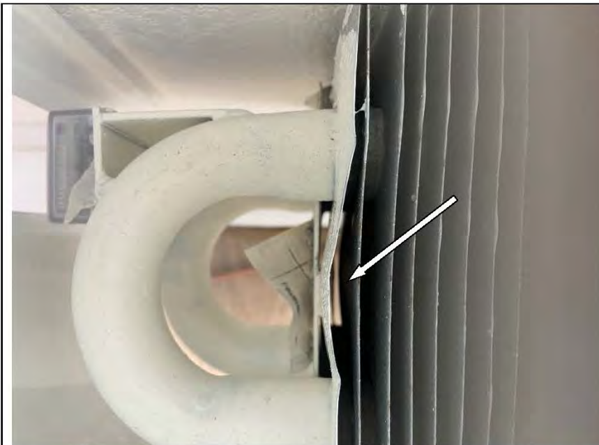
Фото №58. Неровности, подтеки на окрашенных трубах отопления в кухне.
