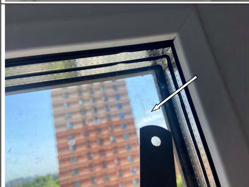
Фото №53. Царапина на стеклопакете оконного блока ПВХ в кабинете.
