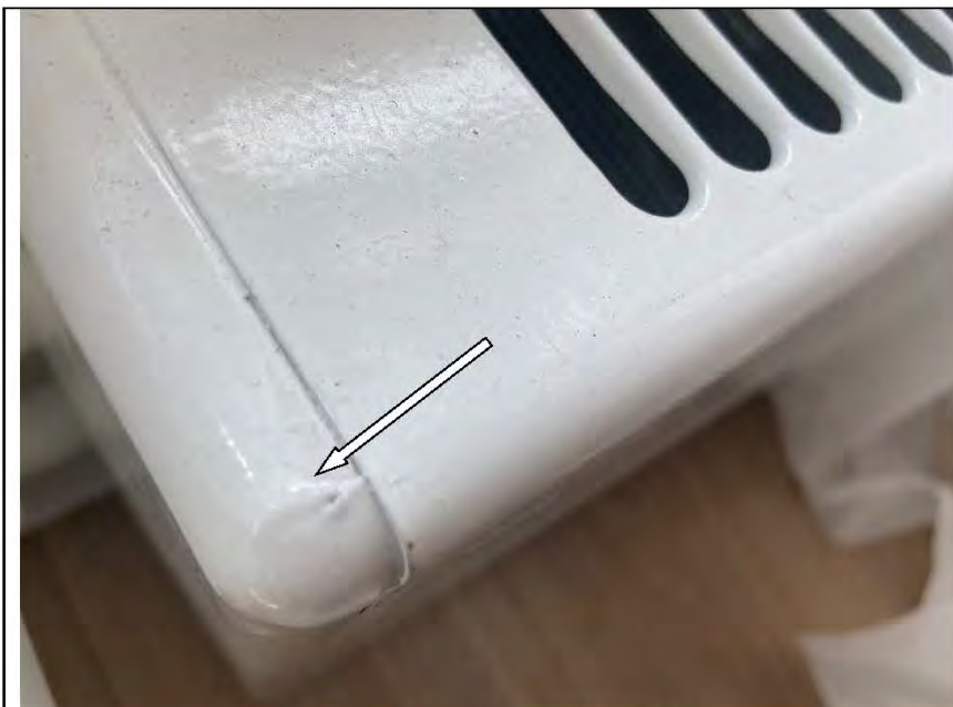
Фото №88. Загиб на металлическом кожухе отопительного прибора в спальне.
