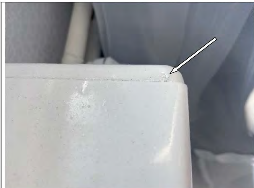
Фото №91. Загиб на металлическом кожухе отопительного прибора в кухне.
