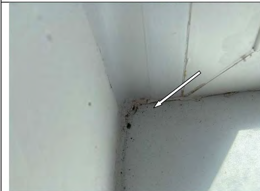
Фото №44. Дефект на лицевой стороне подоконной доски в кабинете.
