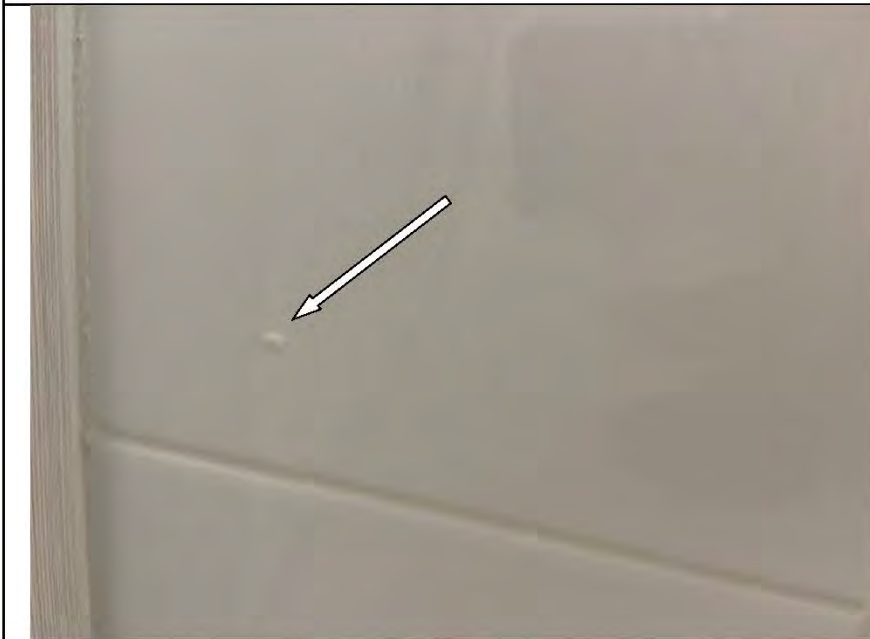
Фото №15. Загрязнения на настенной керамической плитке в санузле.
