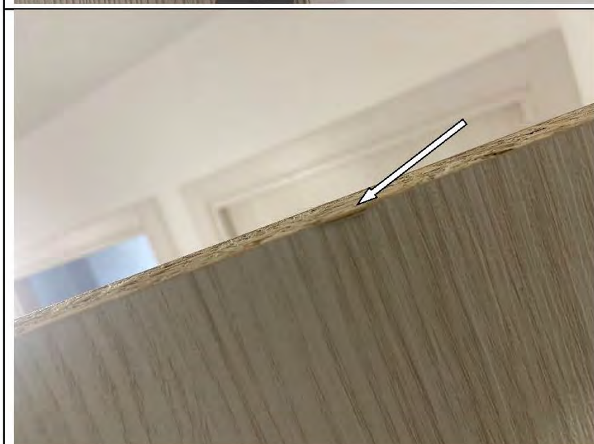
Фото №68. Загрязнения на полотне деревянного дверного блока в ванной комнате.
