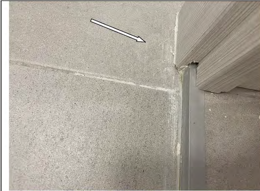
Фото №28. Загрязнения на напольной керамической плитке в санузле.
