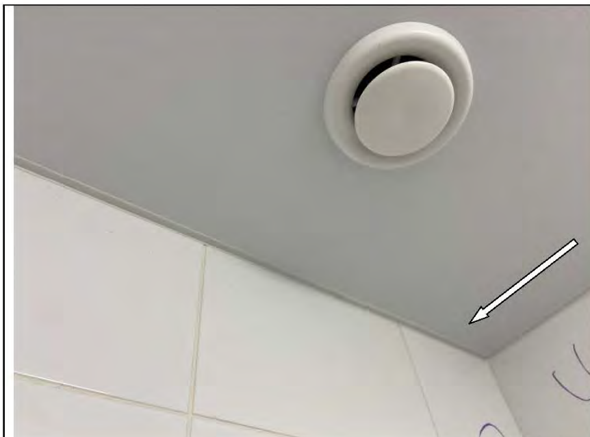
Фото №85. Загрязнения на полотне натяжного потолка в санузле.
