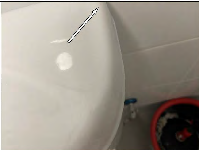
Фото №96. Загрязнения на раковине в ванной комнате.
