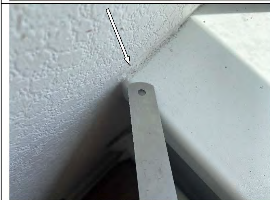
Фото №42. Дефект на лицевой стороне подоконной доски в спальне.
