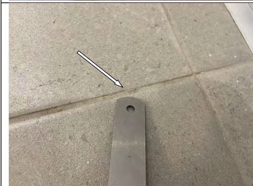
Фото №33. Неровные швы напольной керамической плитки в кухне.
