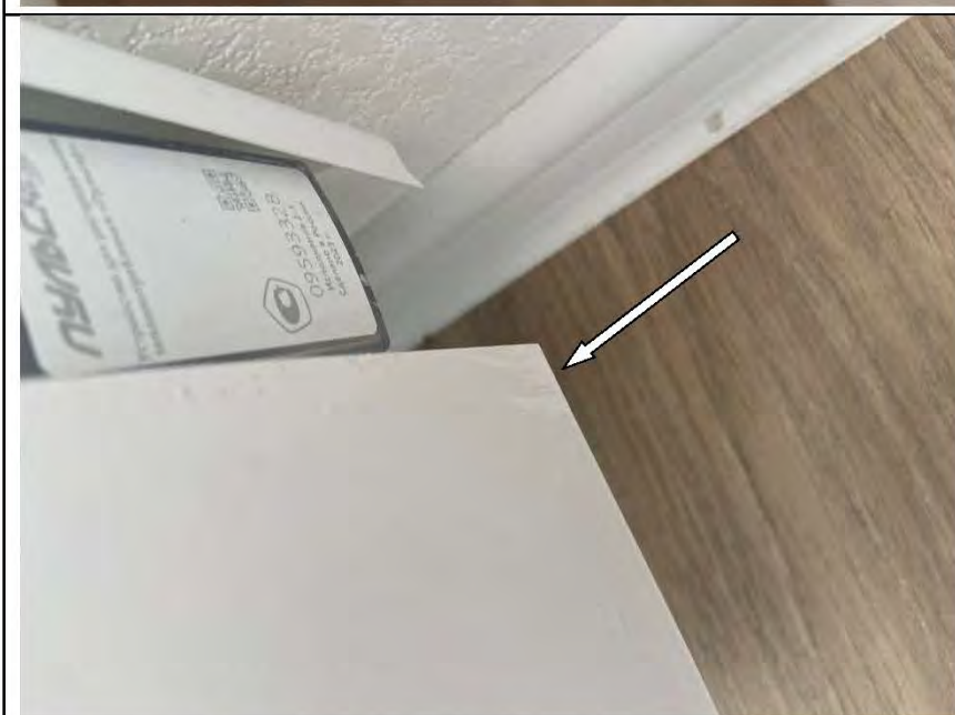
Фото №89. Загрязнения на металлическом кожухе отопительного прибора в спальне.
