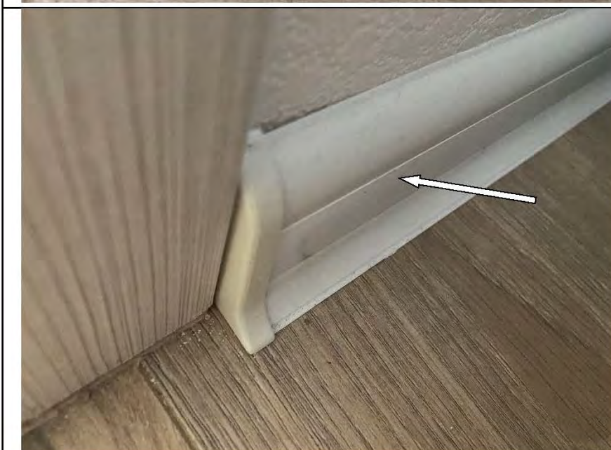
Фото №35. Дефект на напольном плинтусе ПВХ в спальне.
