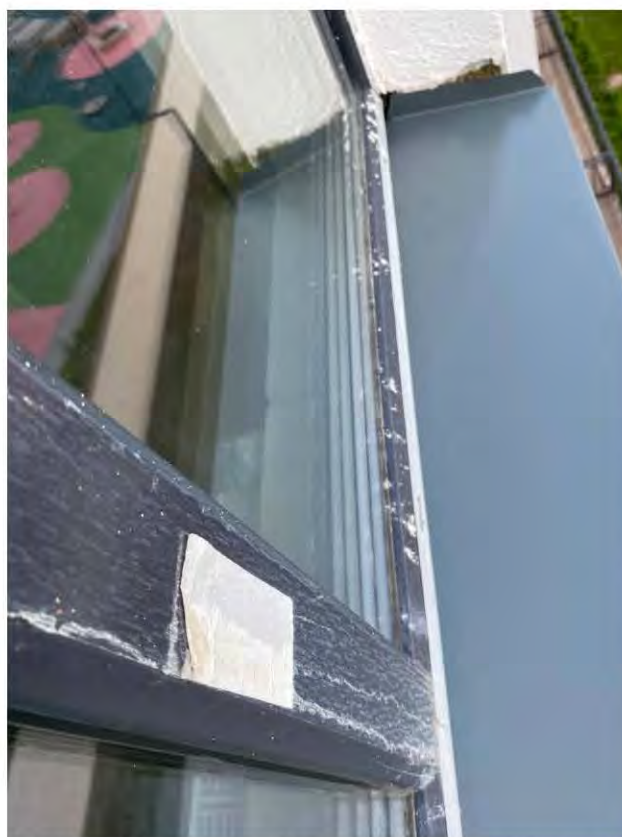
Фото 24. Кухня-Гостиная (15,4 кв.м.) 2.5 Отсутствуют капельники на оконном блоке
