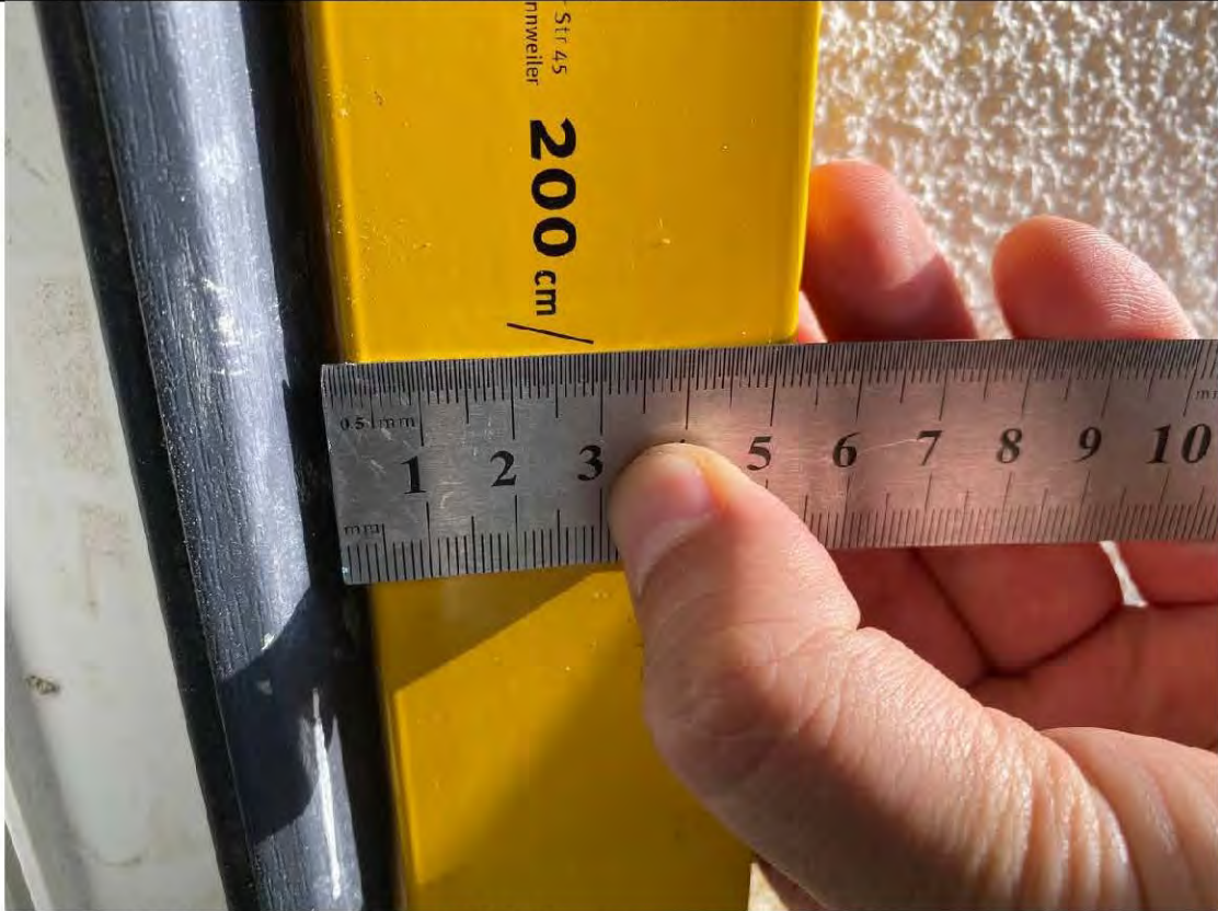
Фото 28. Комната 1 (12,7 кв.м.) 3.3 Отклонение оконного блока от плоскости 3 мм
