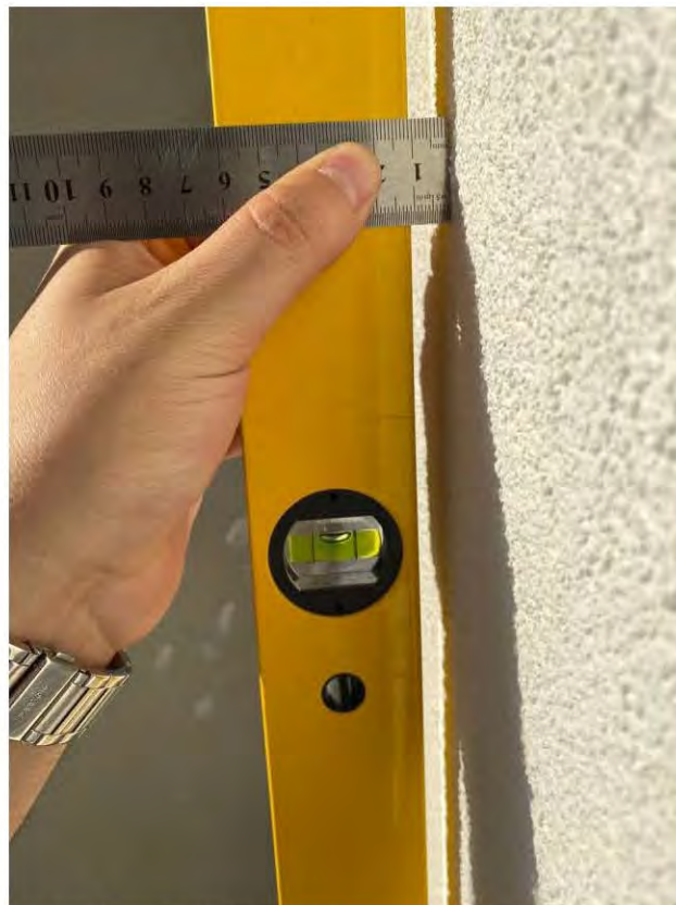
Фото 29. Лоджия (3,7 кв.м.) 4.1 Отклонение участка стены от вертикали 11 мм
