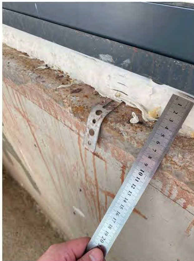
Фото 31. Лоджия (3,7 кв.м.) 4.3 Отслоение окрасочного слоя, наличие коррозии на металлических ограждениях
