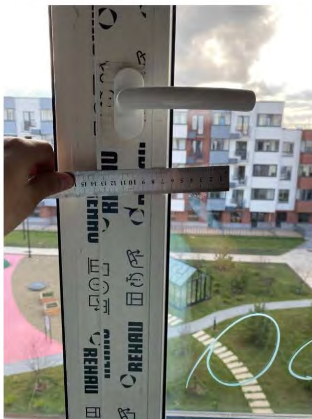
Фото 22. Кухня-Гостиная (15,4 кв.м.) 2.3 При открывании и закрывании обнаружено отклонение в работе одной оконной створки
