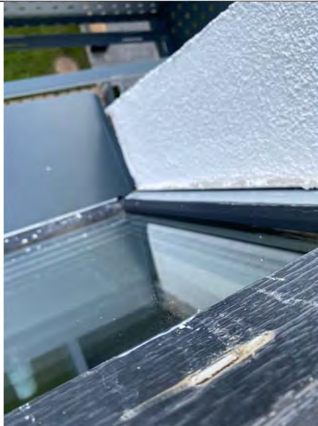
Фото 23. Кухня-Гостиная (15,4 кв.м.) 2.4 Отсутствует герметизация в месте соединения откоса и оконного отлива
