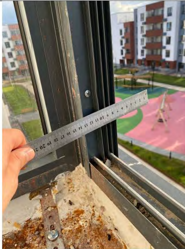
Фото 32. Лоджия (3,7 кв.м.) 4.4 Механическое повреждение на профиле витражной конструкции
