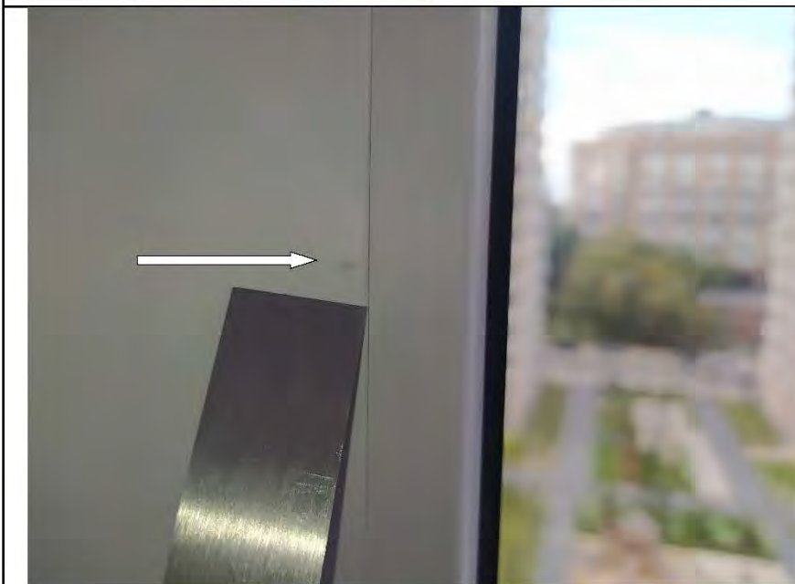
Фото №32. Профиль ПВХ оконного блока в спальне имеет дефекты (скол).
