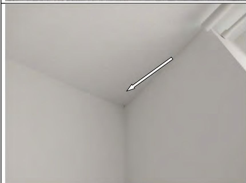
Фото №63. Дефект монтажа декоративного молдинга натяжного потолка в кабинете.
