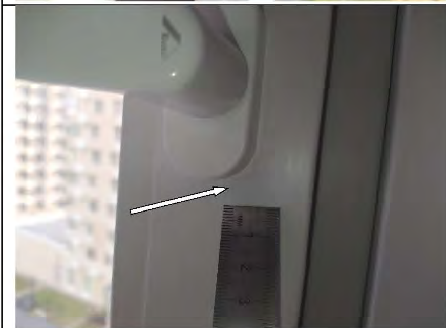
Фото №36. Профиль ПВХ оконного блока в кухне имеет дефекты (царапины).
