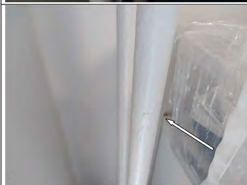
Фото №71. Окрашивание труб отопления выполнено с дефектами (подтеки) в спальне
