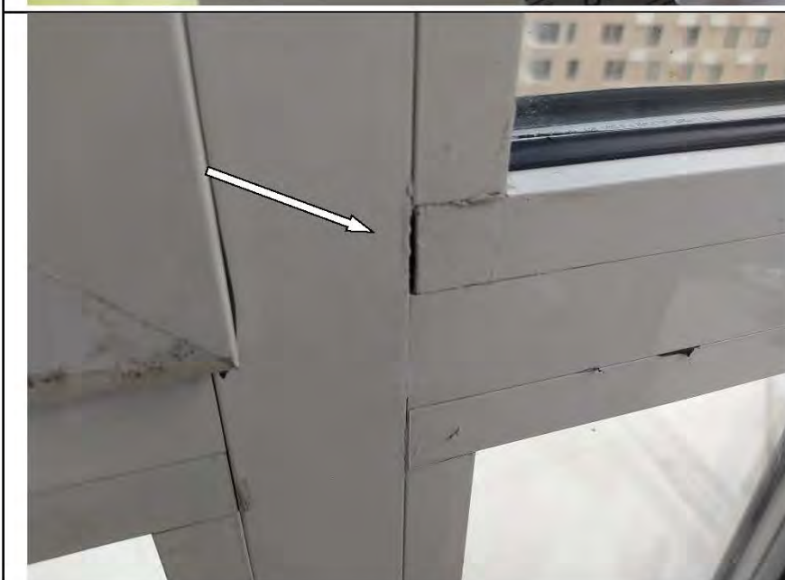
Фото №39. Дефект на металлическом профиле (зазор) оконного блока в гостиной.
