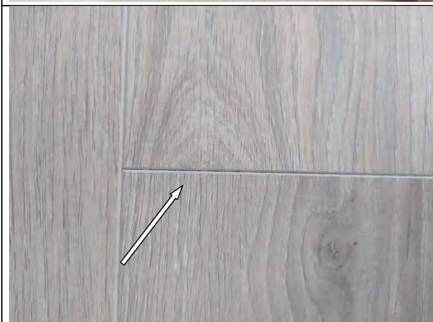
Фото №62. Зазор между соседними досками ламината в гостиной
