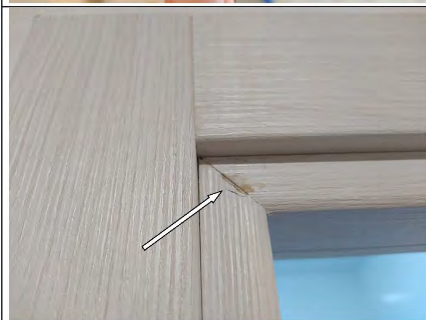
Фото №45. Коробка деревянного дверного блока в прачечной имеет дефекты (скол).
