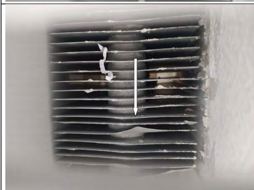
Фото №68. Радиатор в кабинете имеет дефекты (замятия)
