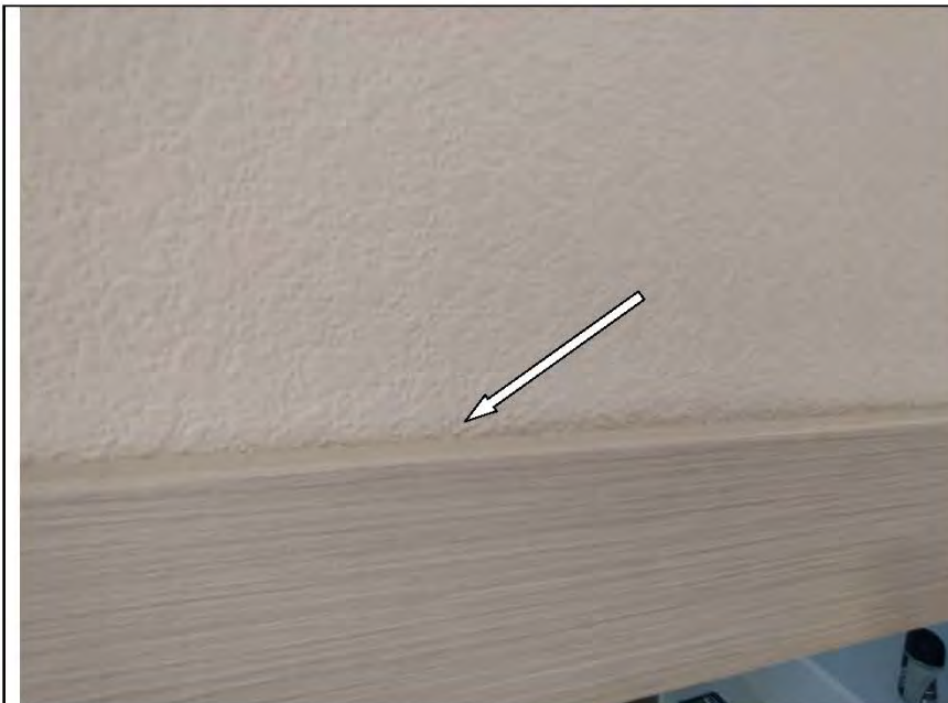
Фото №55. Неплотное прилегание дверного наличника к стене в кабинете
