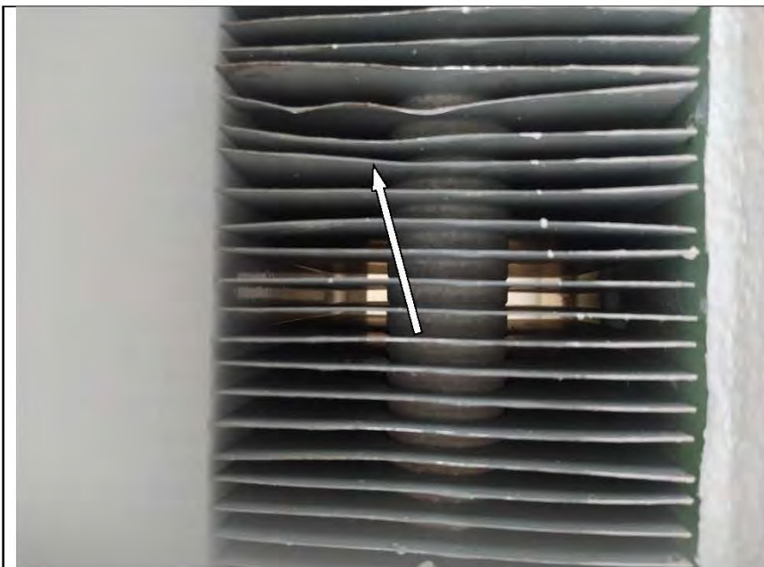
Фото №67. Радиатор в спальне имеет дефекты (замятия)
