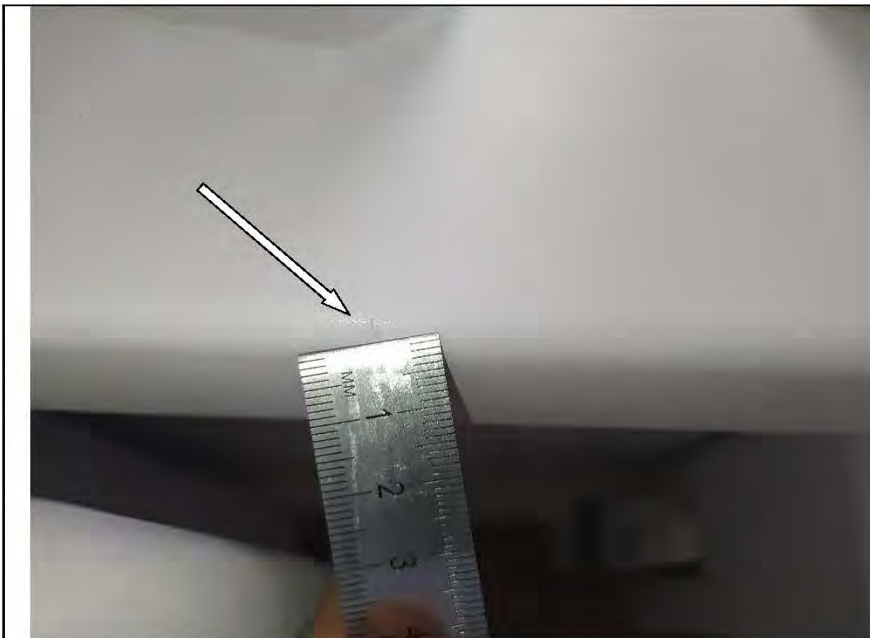
Фото №40. На лицевой поверхности подоконной доски в кухне имеются дефекты (царапины).
