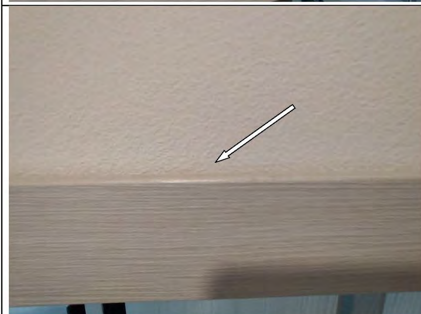
Фото №56. Неплотное прилегание дверного наличника к стене в гостиной
