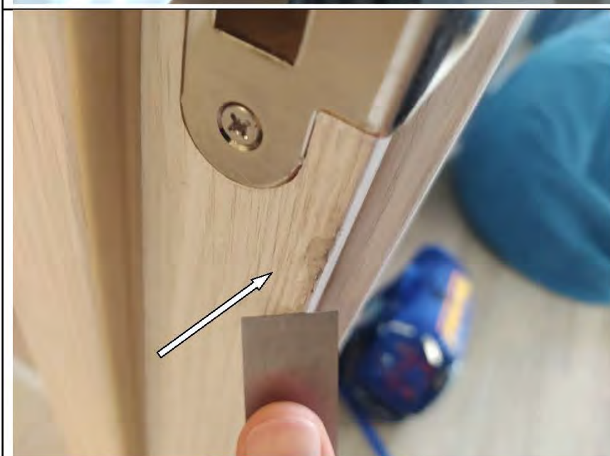
Фото №44. Коробка деревянного дверного блока в гостиной имеет дефекты (скол).
