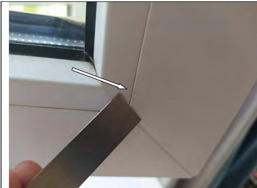
Фото №37. Профиль ПВХ оконного блока №1 в гостиной имеет дефекты (скол).
