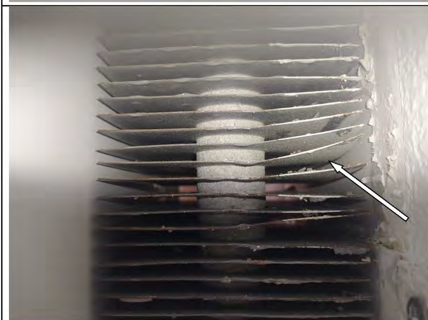
Фото №66. Радиатор в кухне имеет дефекты (замытия)
