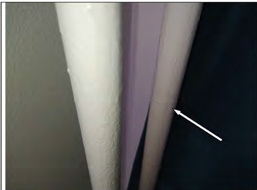
Фото №70. Окрашивание труб отопления выполнено с дефектами (подтеки) в кухне
