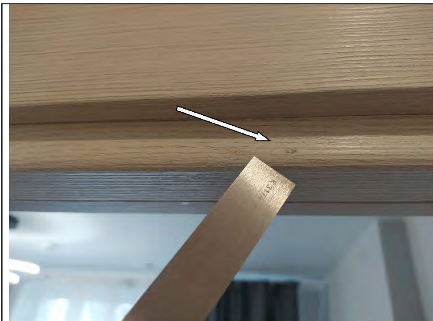
Фото №43. Коробка деревянного дверного блока в спальне имеет дефекты (скол).
