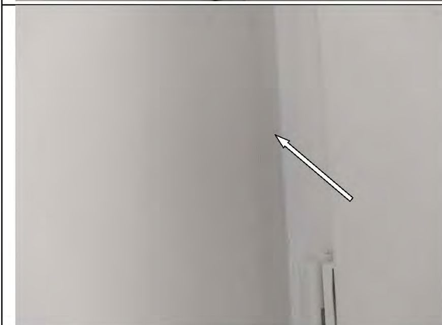
Фото №27. Окрашенные откосы оконного блока ПВХ в кухне выполнены с дефектами (подтеки).
