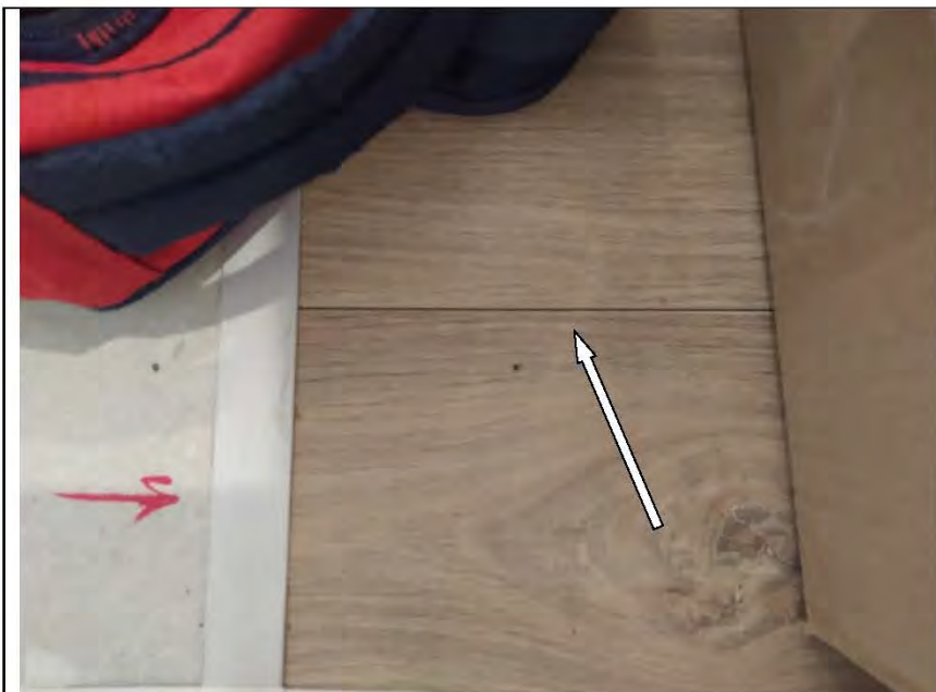
Фото №61. Зазор между соседними досками ламината в кухне.
