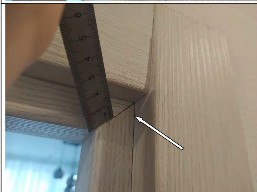
Фото №51. Элементы дверного блока (коробка) соединены не надежно в кабинете
