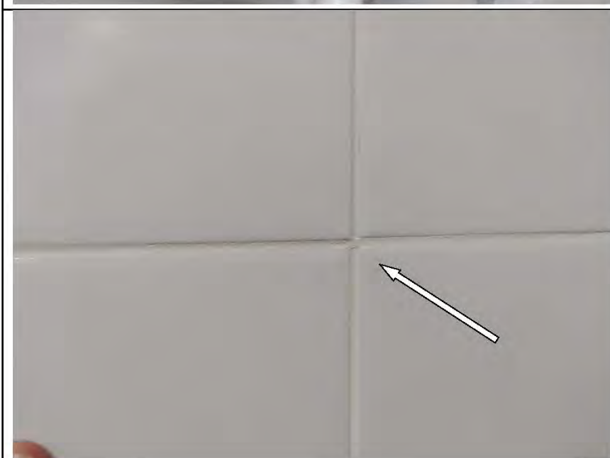
Фото №72. Затирка настенной плитки в ванной комнате выполнена с нарушениями.
