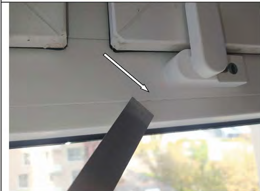
Фото №35. Профиль ПВХ оконного блока в кухне имеет дефекты (сколы).
