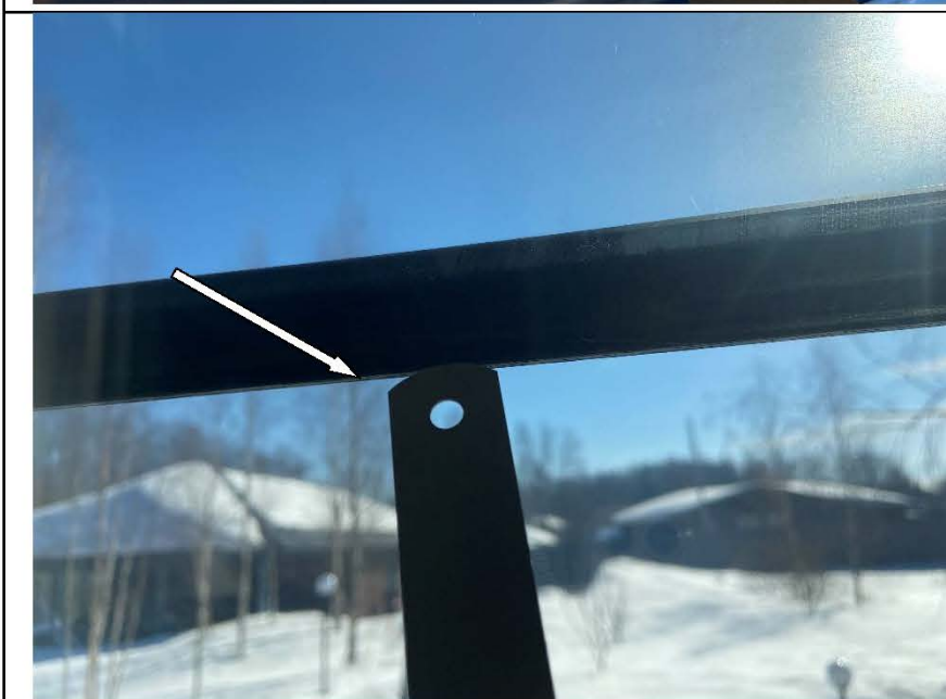
Фото №29. Царапины на стеклопакете оконного блока в жилом доме.
