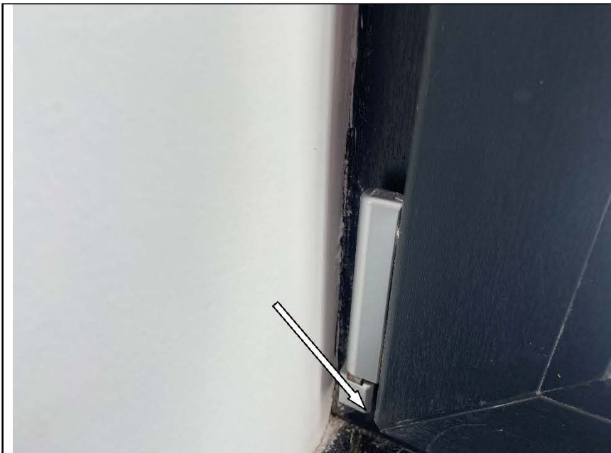
Фото №49. Механический дефект на профиле оконного блока в жилом доме.
