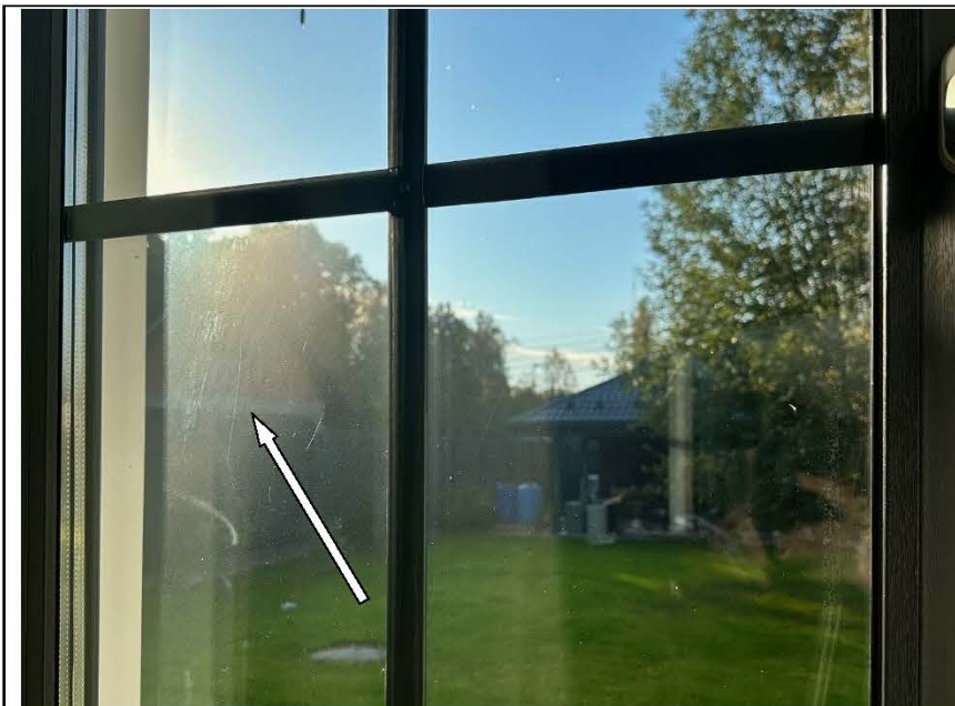
Фото №61. Помутнения на стеклопакете оконного блока в жилом доме.
