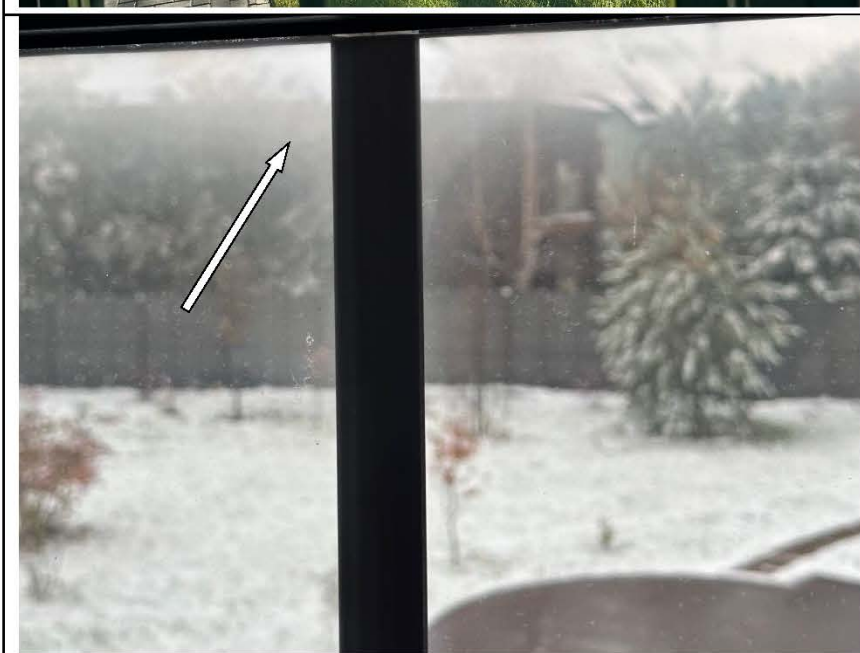
Фото №66. Помутнения на стеклопакете оконного блока в жилом доме.
