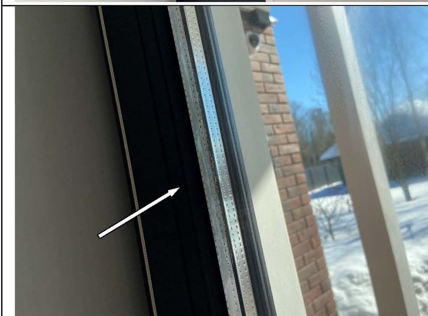
Фото №39. Механический дефект на профиле оконного блока в жилом доме.
