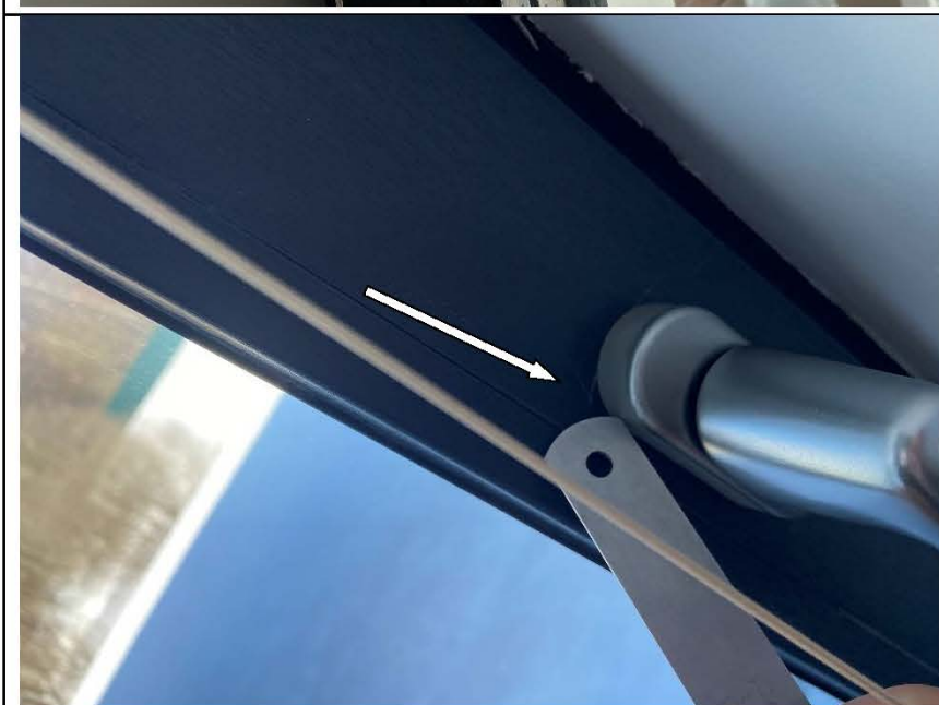
Фото №54. Механический дефект на профиле оконного блока в жилом доме.
