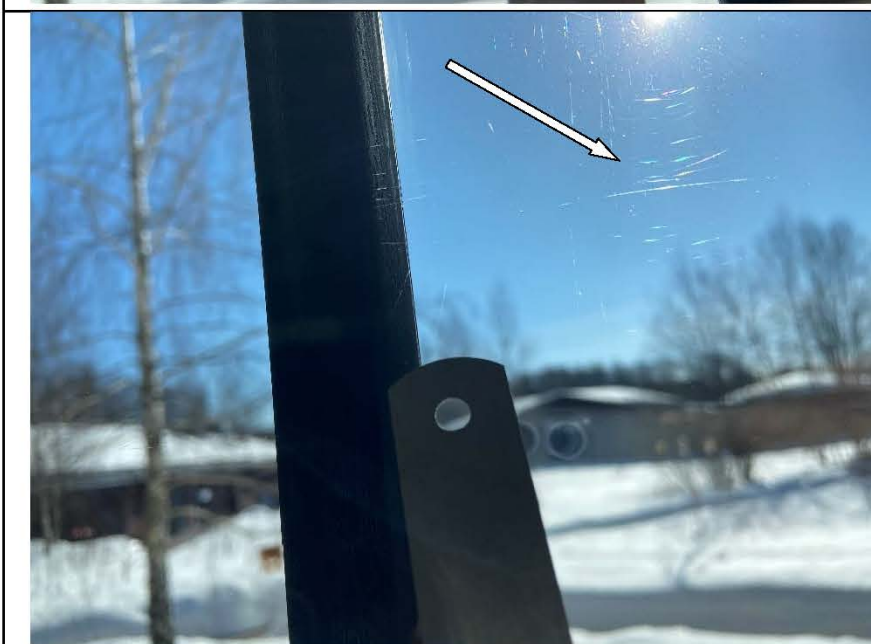
Фото №17. Царапины на стеклопакете оконного блока в жилом доме.
