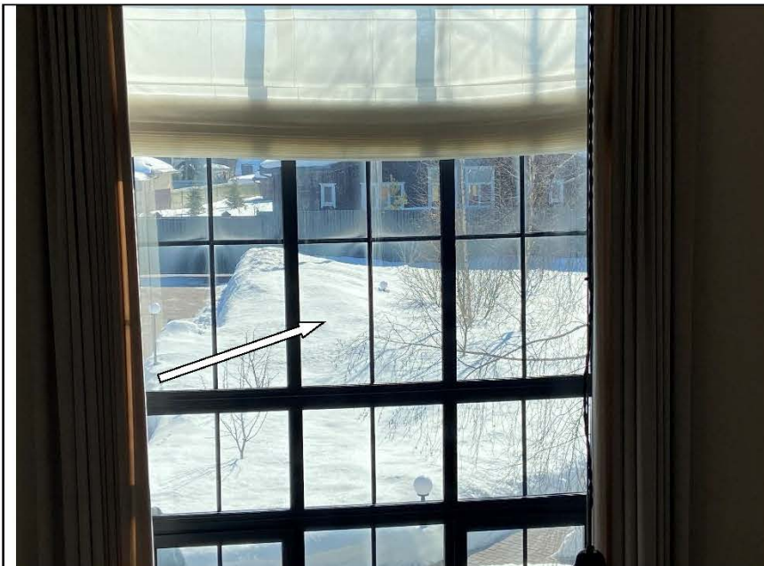
Фото №79. Запотевания на оконном блоке в жилом доме.
