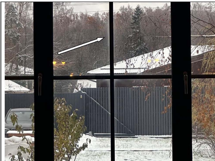
Фото №73. Помутнения на стеклопакете оконного блока в жилом доме.
