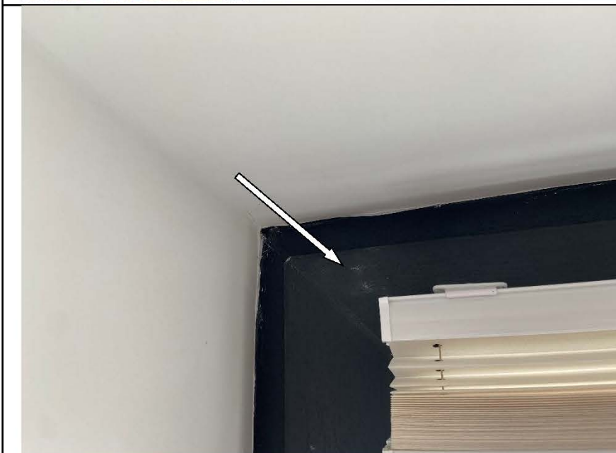
Фото №38. Механический дефект на профиле оконного блока в жилом доме.
