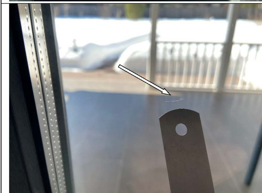
Фото №12. Царапины на стеклопакете оконного блока в жилом доме.
