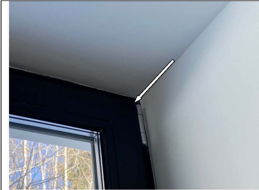
Фото №37. Механический дефект на профиле оконного блока в жилом доме.
