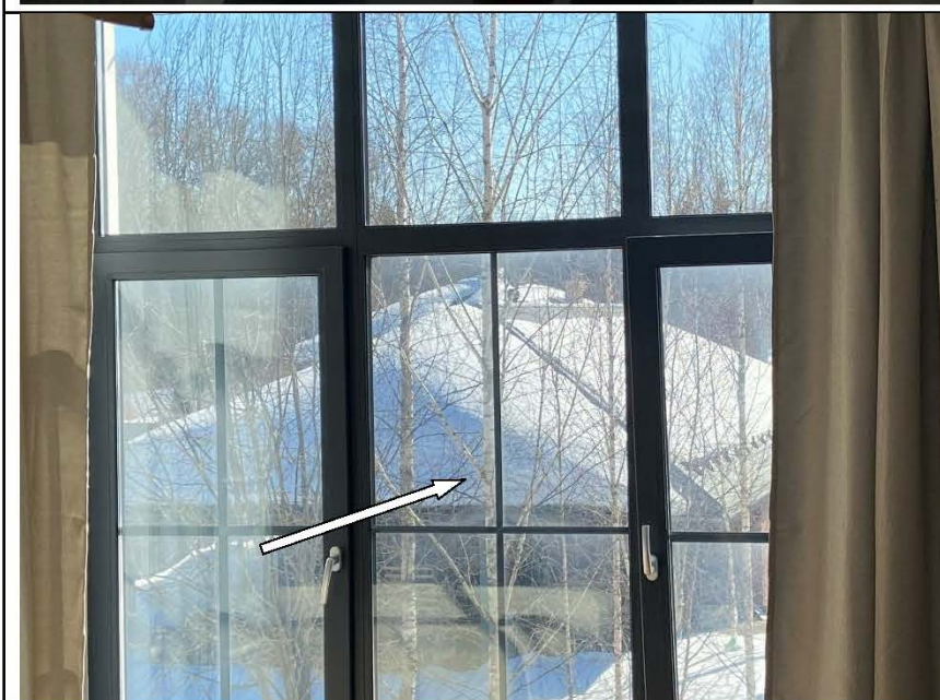
Фото №78. Запотевания на оконном блоке в жилом доме.
