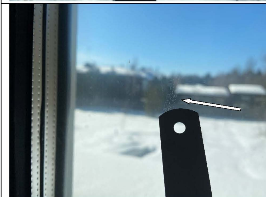
Фото №30. Царапины на стеклопакете оконного блока в жилом доме.
