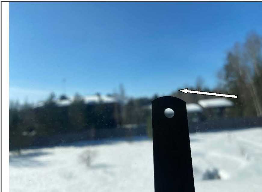
Фото №31. Царапины на стеклопакете оконного блока в жилом доме.
