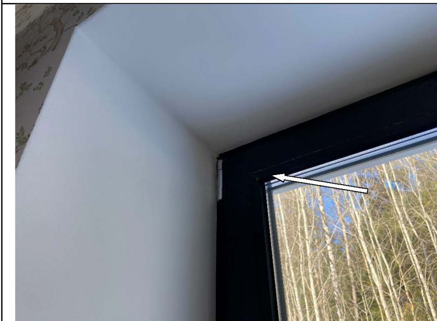
Фото №35. Механический дефект на профиле оконного блока в жилом доме..
