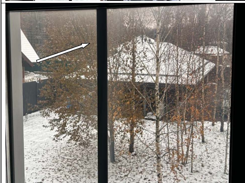
Фото №72. Помутнения на стеклопакете оконного блока в жилом доме.
