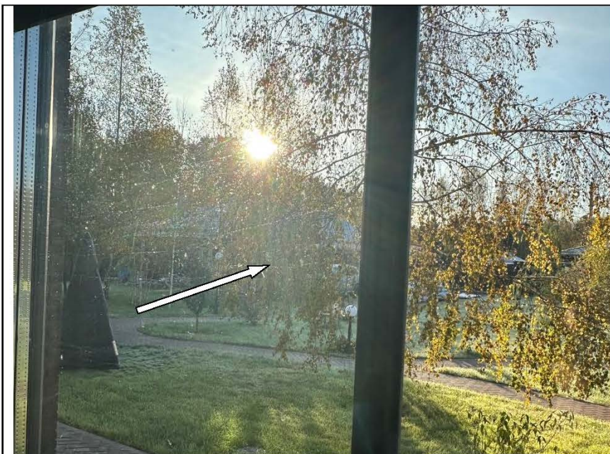
Фото №64. Помутнения на стеклопакете оконного блока в жилом доме.
