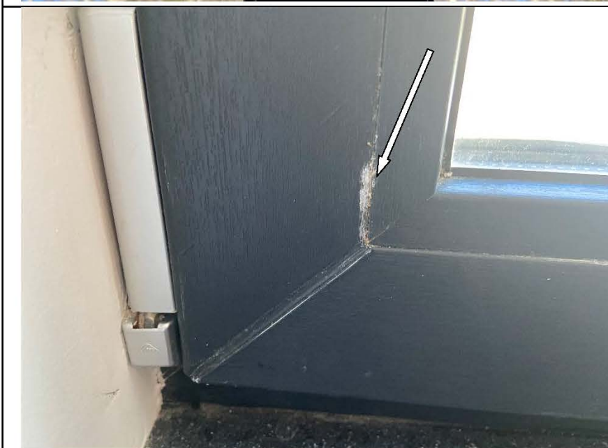
Фото №48. Механический дефект на профиле оконного блока в жилом доме.
