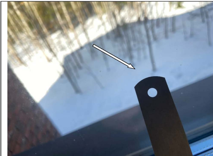
Фото №28. Царапины на стеклопакете оконного блока в жилом доме.
