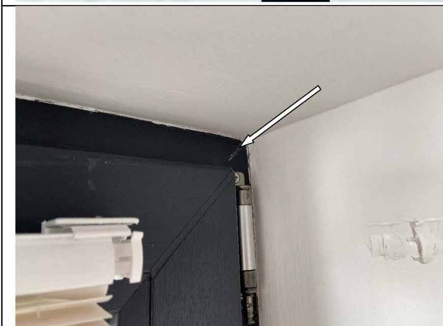
Фото №32. Механический дефект на профиле оконного блока в жилом доме.
