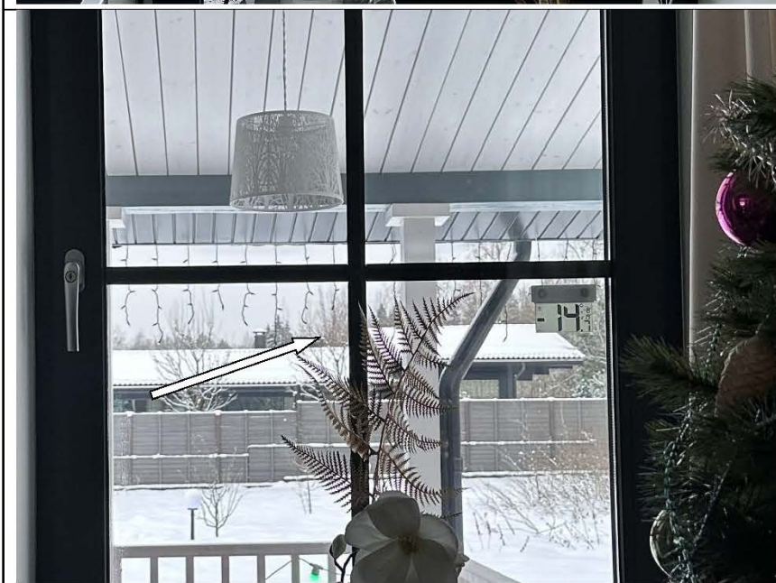
Фото №83. Запотевания на оконном блоке в жилом доме.
