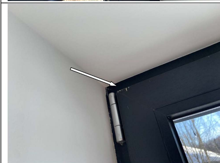
Фото №42. Механический дефект на профиле оконного блока в жилом доме.
