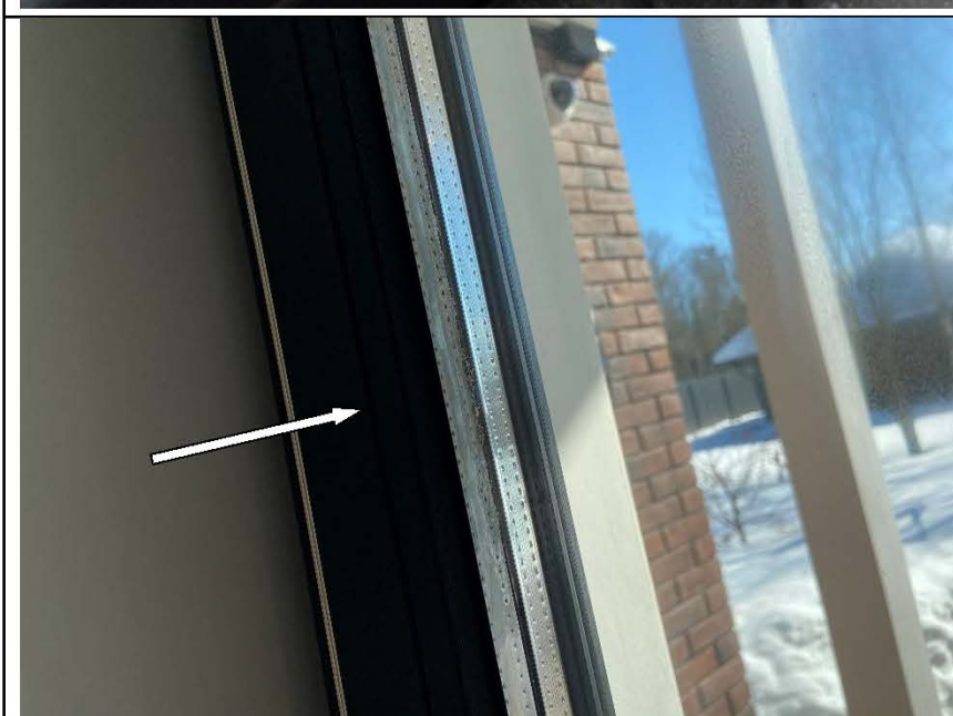
Фото №53. Механический дефект на профиле оконного блока в жилом доме.
