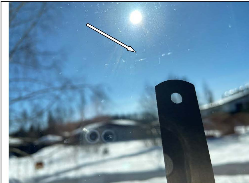
Фото №13. Царапины на стеклопакете оконного блока в жилом доме.
