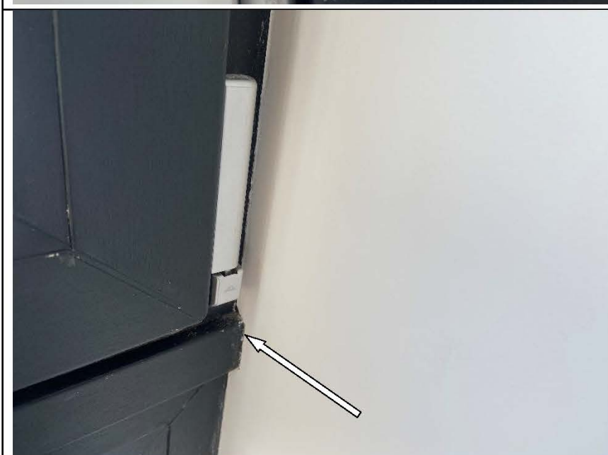
Фото №51. Механический дефект на профиле оконного блока в жилом доме.
