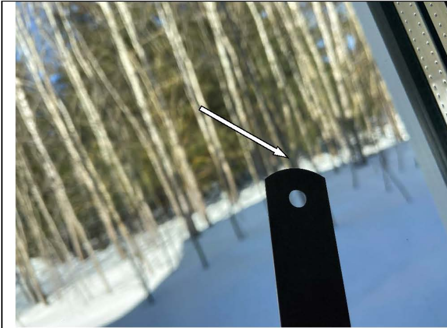
Фото №19. Царапины на стеклопакете оконного блока в жилом доме.
