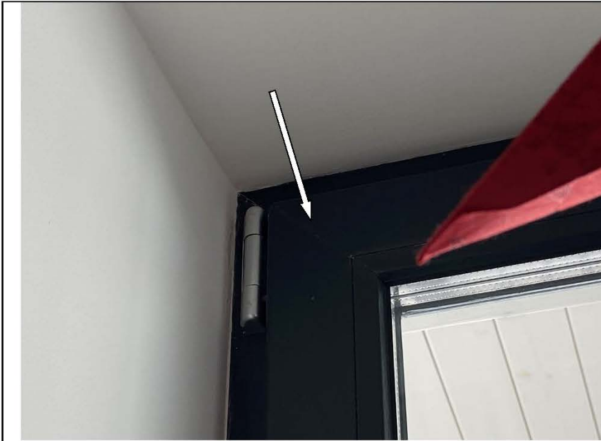
Фото №34. Механический дефект на профиле оконного блока в жилом доме.
