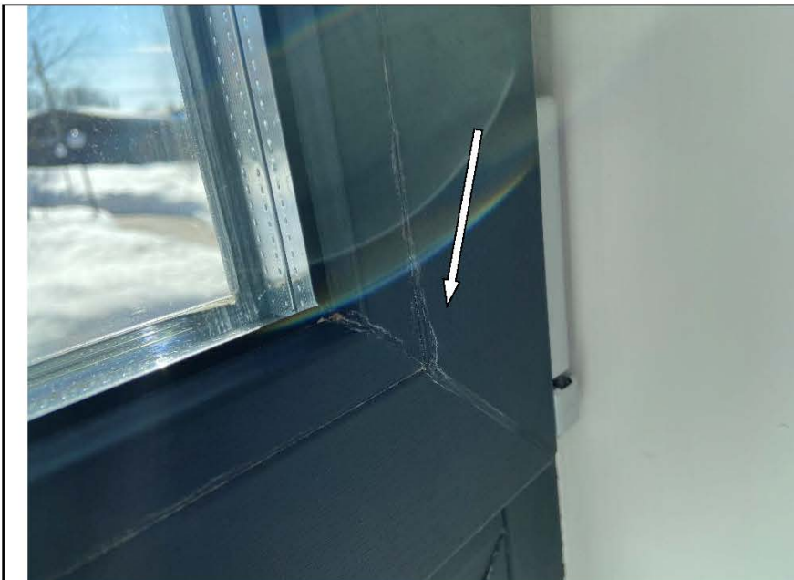
Фото №46. Механический дефект на профиле оконного блока в жилом доме.
