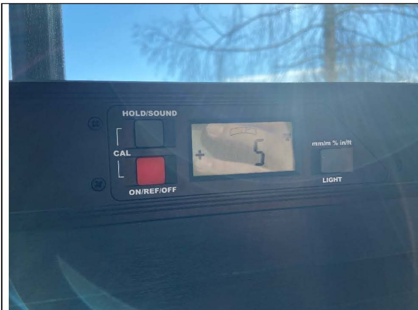
Фото №58. Отклонение прямолинейности и формы створки оконного блока в жилом доме.
