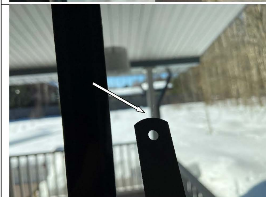
Фото №15. Царапины на стеклопакете оконного блока в жилом доме.
