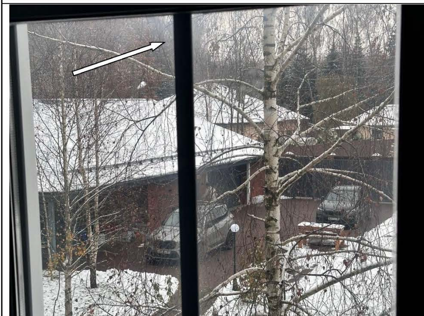
Фото №68. Помутнения на стеклопакете оконного блока в жилом доме.
