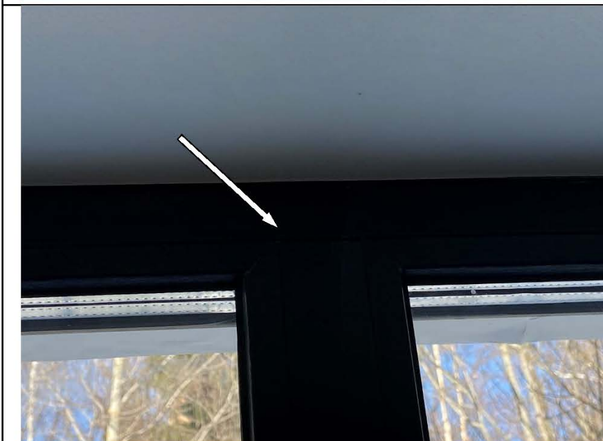
Фото №47. Механический дефект на профиле оконного блока в жилом доме.
