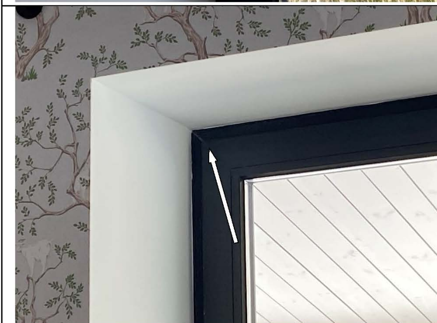
Фото №36. Механический дефект на профиле оконного блока в жилом доме.
