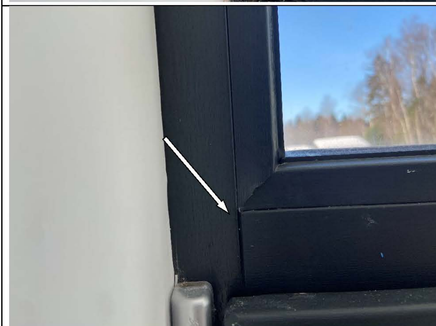
Фото №50. Механический дефект на профиле оконного блока в жилом доме.
