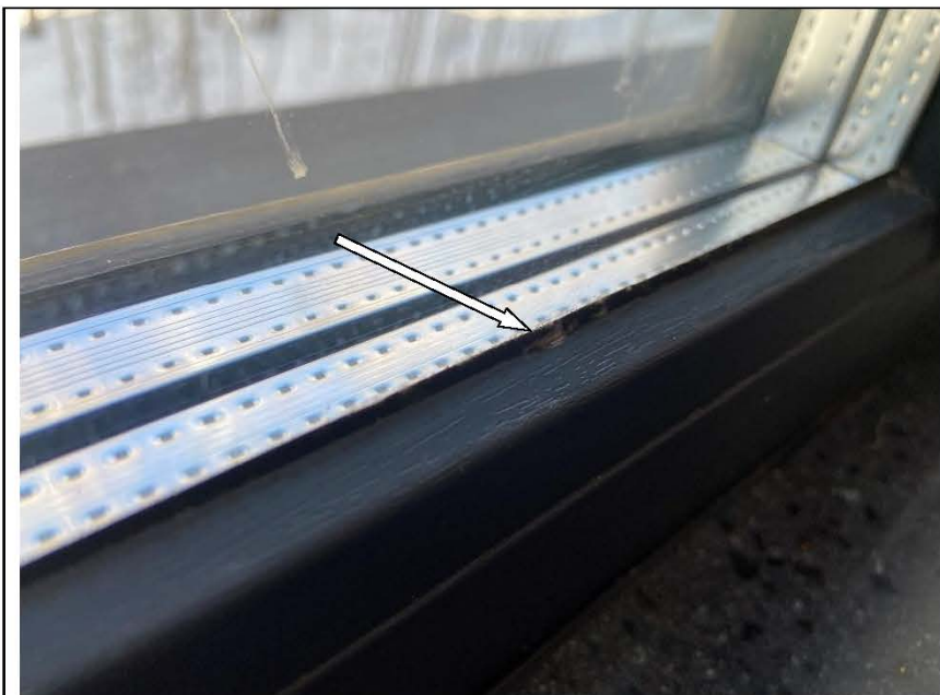
Фото №52. Механический дефект на профиле оконного блока в жилом доме.
