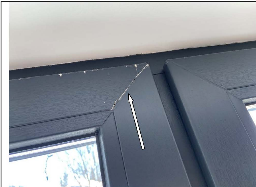
Фото №43. Механический дефект на профиле оконного блока в жилом доме.
