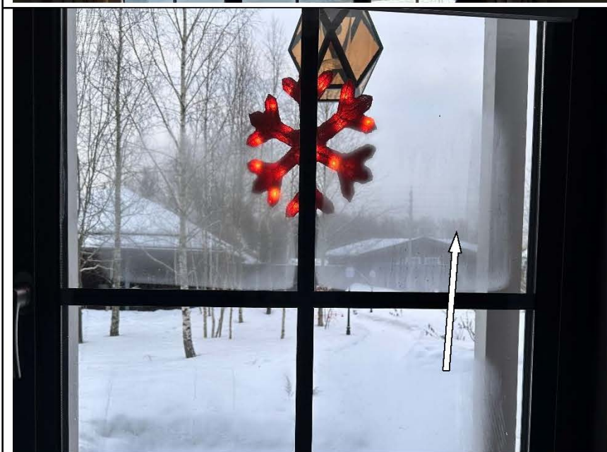
Фото №80. Запотевания на оконном блоке в жилом доме.
