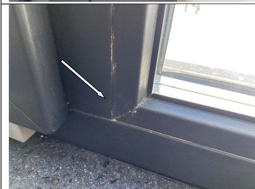
Фото №45. Механический дефект на профиле оконного блока в жилом доме.
