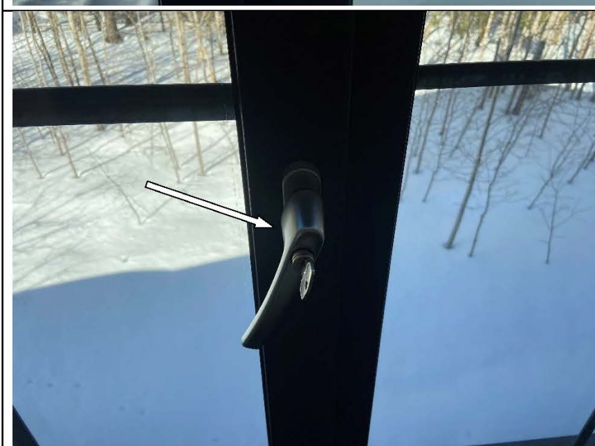
Фото №57. Не отрегулирована фурнитура оконного блока в жилом доме.
