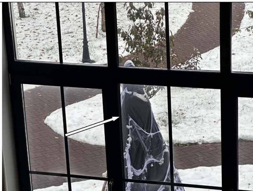
Фото №71. Помутнения на стеклопакете оконного блока в жилом доме.
