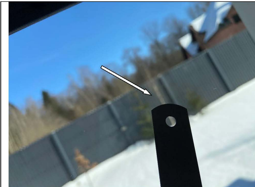
Фото №22. Царапины на стеклопакете оконного блока в жилом доме.
