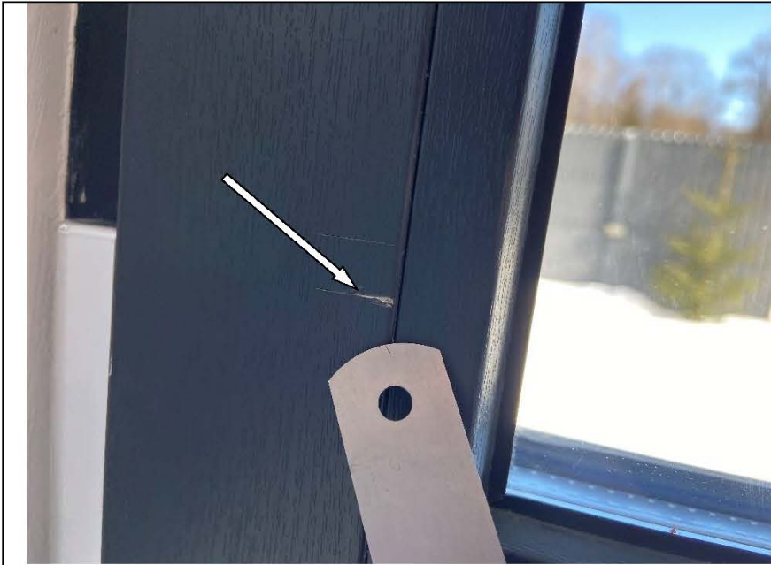
Фото №40. Механический дефект на профиле оконного блока в жилом доме.
