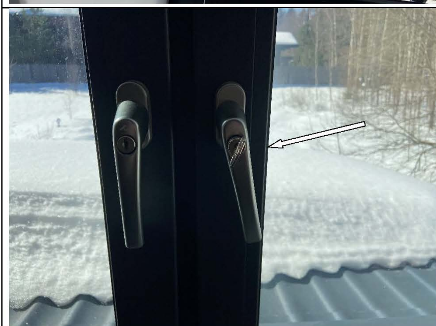
Фото №56. Не отрегулирована фурнитура оконного блока в жилом доме.
