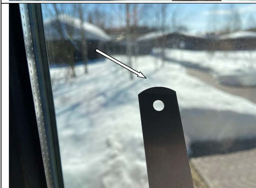
Фото №14. Царапины на стеклопакете оконного блока в жилом доме.
