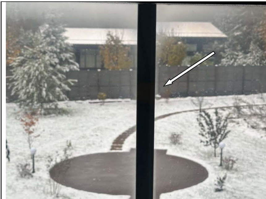
Фото №70. Помутнения на стеклопакете оконного блока в жилом доме.
