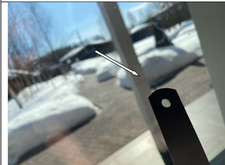
Фото №20. Царапины на стеклопакете оконного блока в жилом доме.
