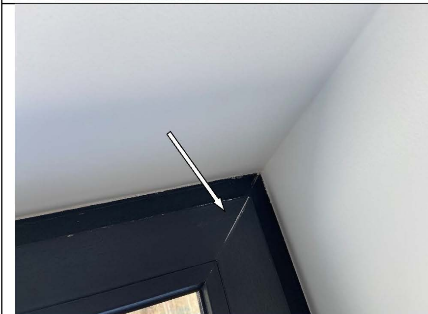
Фото №41. Механический дефект на профиле оконного блока в жилом доме.
