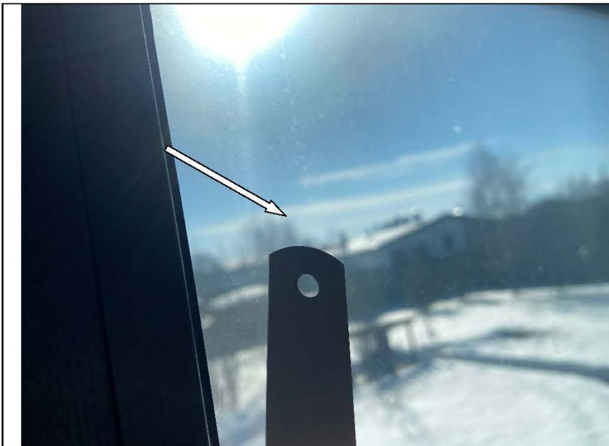
Фото №25. Царапины на стеклопакете оконного блока в жилом доме.
