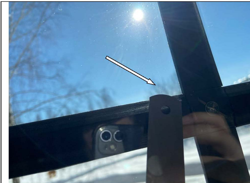
Фото №16. Царапины на стеклопакете оконного блока в жилом доме.
