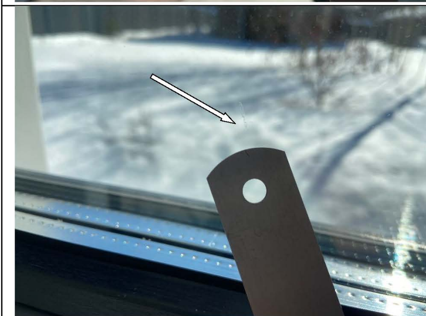
Фото №21. Царапины на стеклопакете оконного блока в жилом доме.
