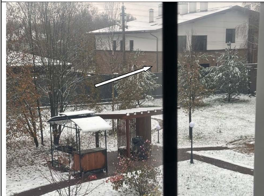
Фото №69. Помутнения на стеклопакете оконного блока в жилом доме.
