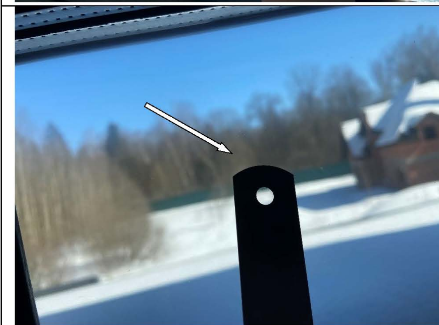
Фото №24. Царапины на стеклопакете оконного блока в жилом доме.
