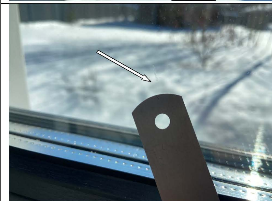
Фото №23. Царапины на стеклопакете оконного блока в жилом доме.
