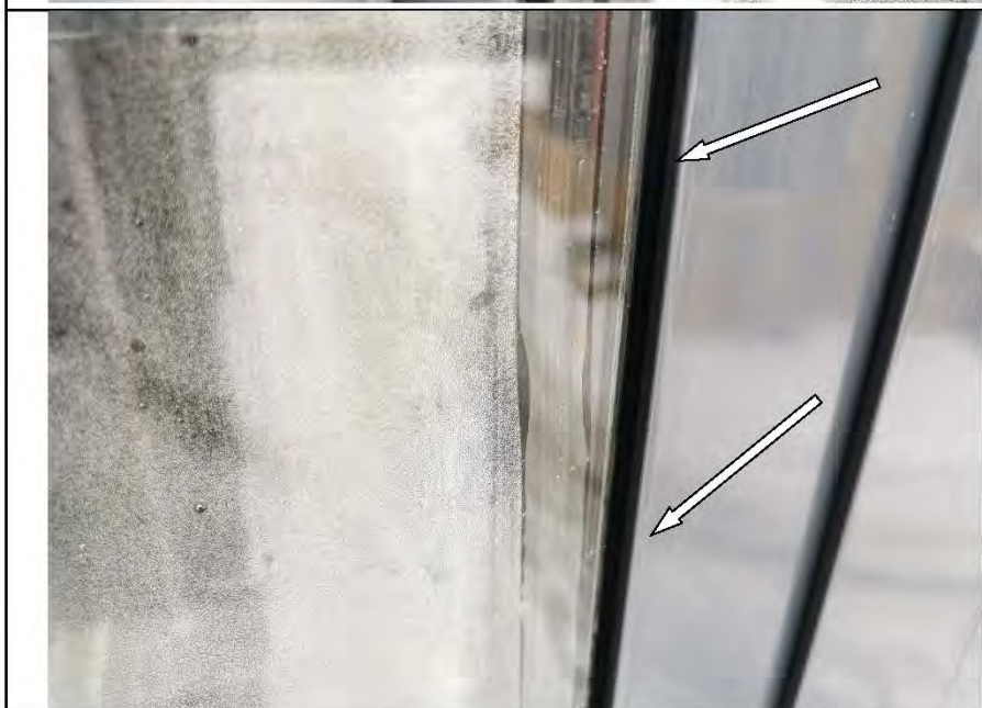
Фото №69. Отсутствует часть уплотняющей прокладки на металлическом оконном блоке на лоджии.
