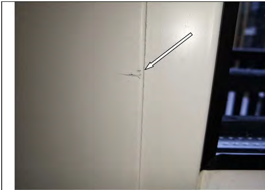
Фото №34. Царапины на профиле ПВХ оконного блока в спальне.
