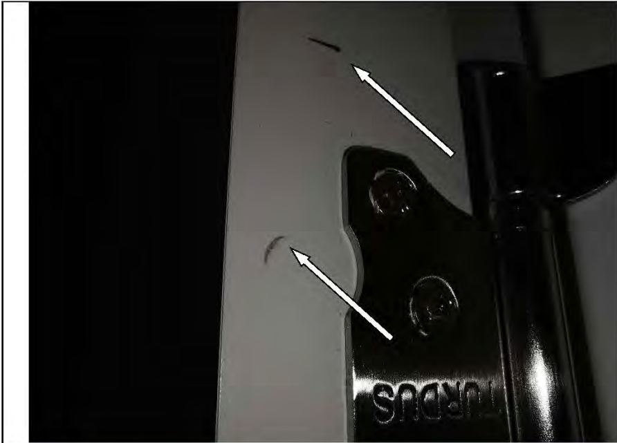
Фото №52. Царапины на полотне деревянного дверного блока в спальне.
