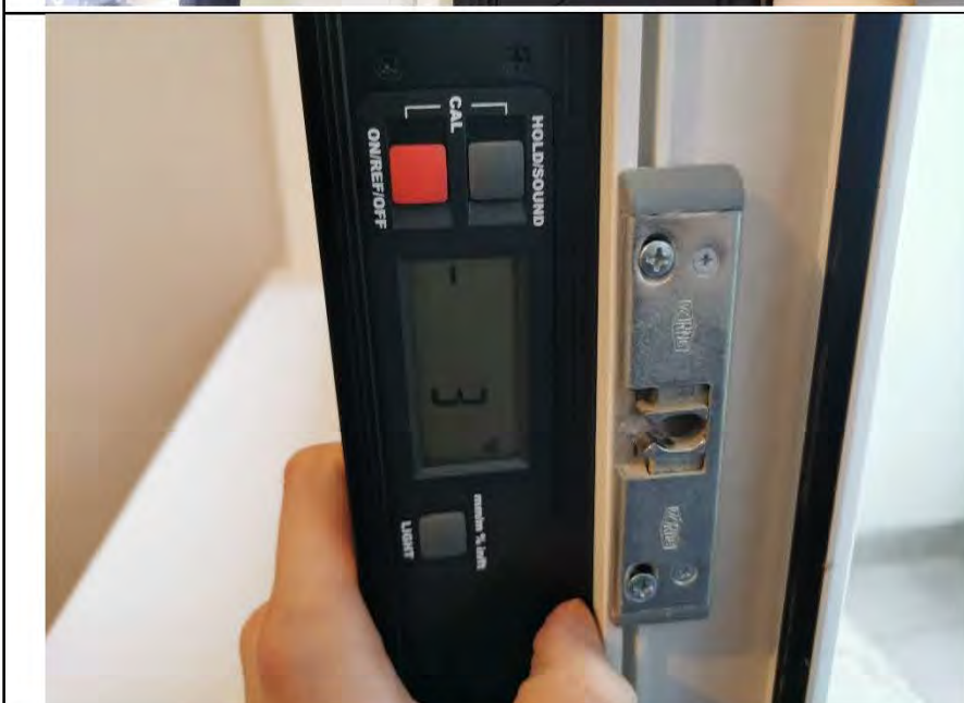
Фото №78. Отклонение ПВХ дверного блока по уровню вертикальности на кухне.
