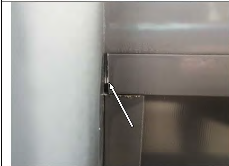
Фото №65. Дефект на металлическом профиле (зазор) оконного блока на лоджии.
