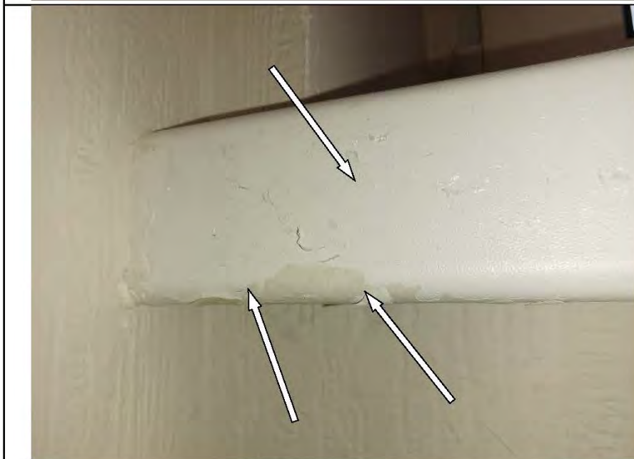
Фото №47. Загрязнение на лицевой поверхности подоконной доски оконного блока ПВХ на кухне.
