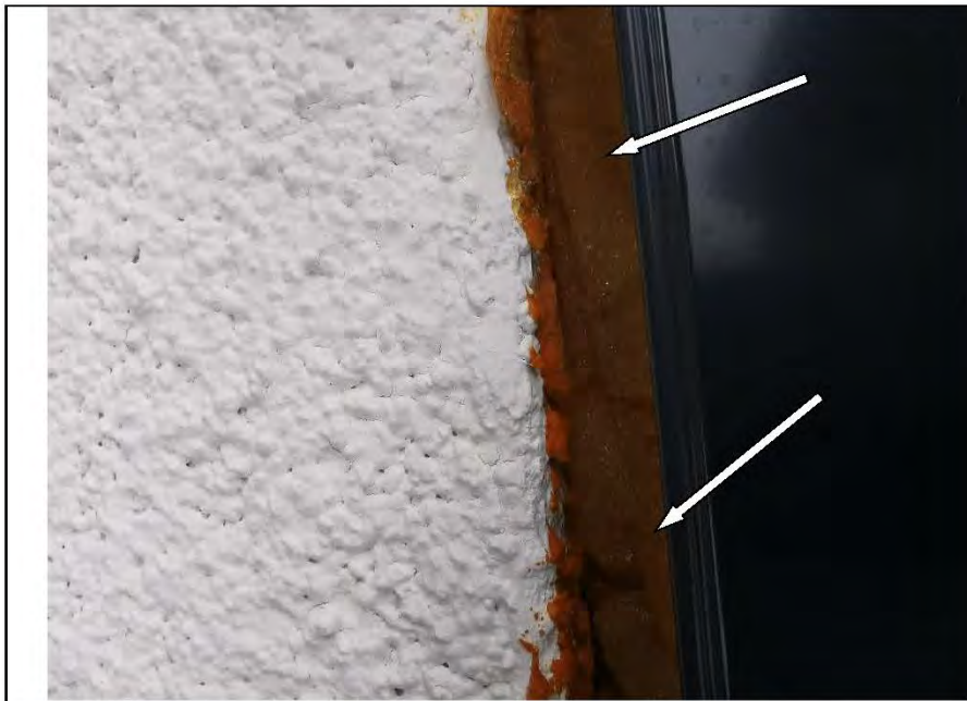
Фото №70. Щель в узле примыкания металлического оконного блока к стене на лоджии.
