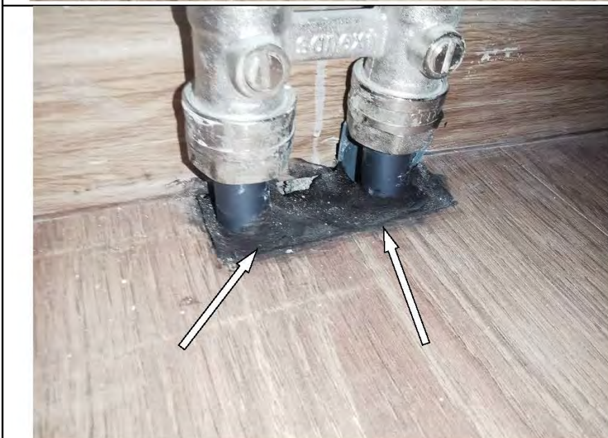
Фото №23. Заделка отверстия для трубопровода отопления в напольном покрытии из ламината выполнена с дефектом в спальне.
