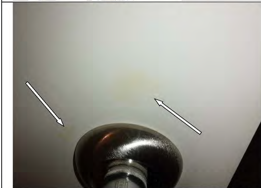
Фото №50. Загрязнение на полотне деревянного дверного блока в ванной комнате.
