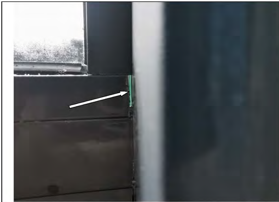
Фото №64. Дефект на металлическом профиле (зазор) оконного блока на лоджии.
