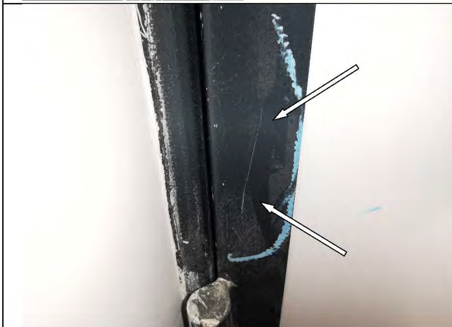
Фото №57. Царапины на коробе входного дверного блока.
