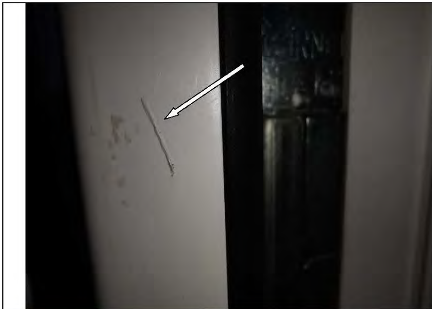
Фото №37. Царапины на профиле ПВХ дверного блока в спальне.
