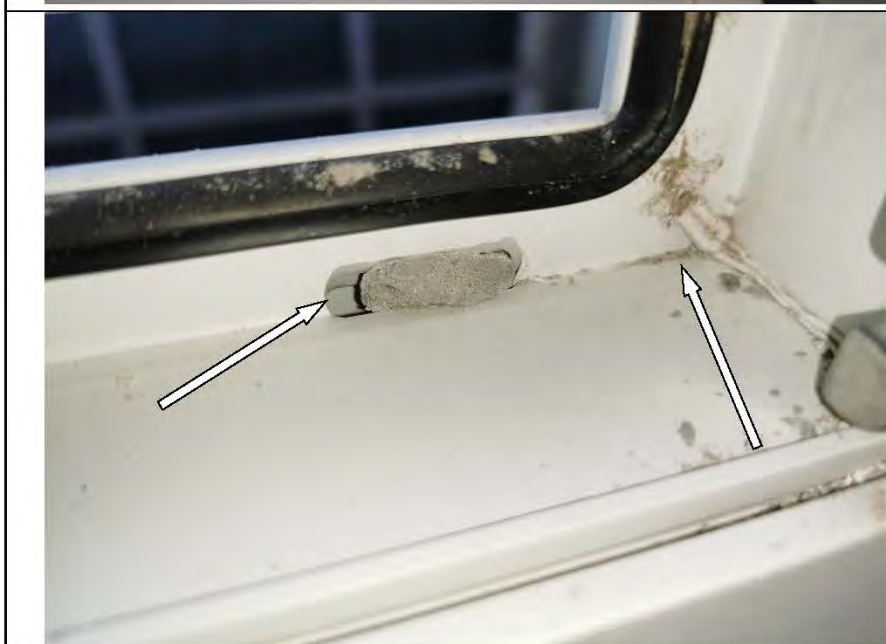
Фото №39. Загрязнение профиля ПВХ оконного блока на кухне.
