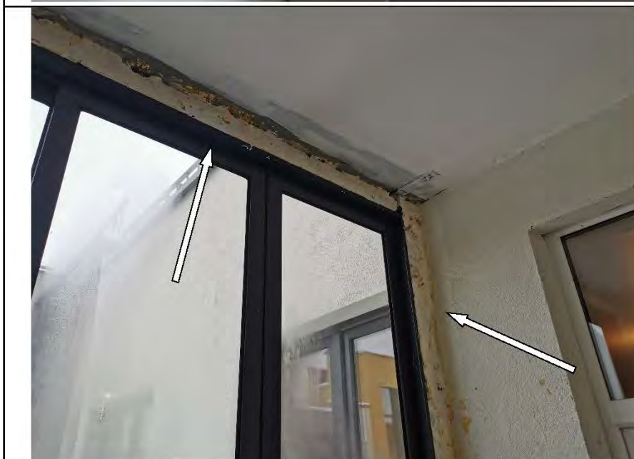
Фото №66. Не установлены нащельники металлического оконного блока на лоджии.
