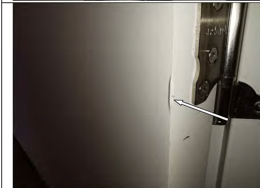
Фото №51. Повреждение ламинации полотна деревянного дверного блока в спальне
