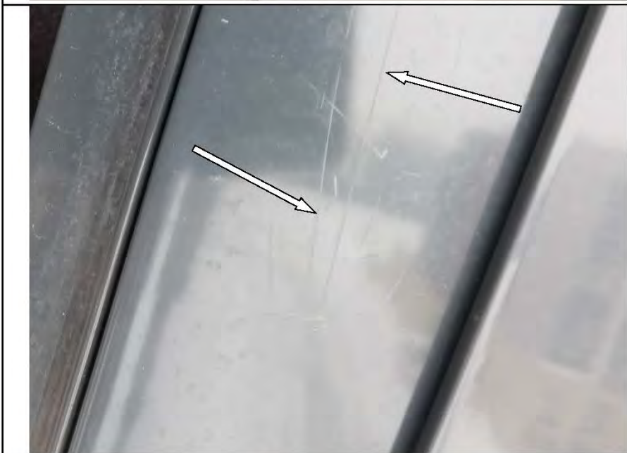
Фото №62. Царапины на профиле металлического оконного блока на лоджии.
