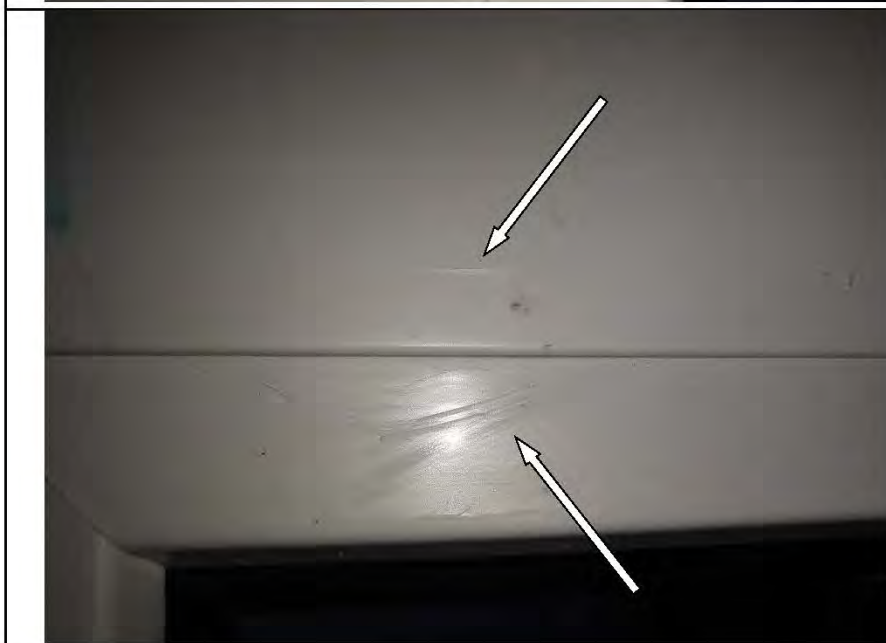
Фото №36. Царапины на профиле ПВХ дверного блока в спальне.
