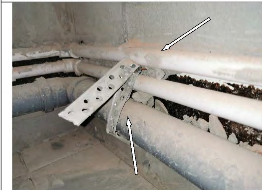
Фото №74. Трубы водоснабжения и канализации под ванной не закреплены надлежащим образом.
