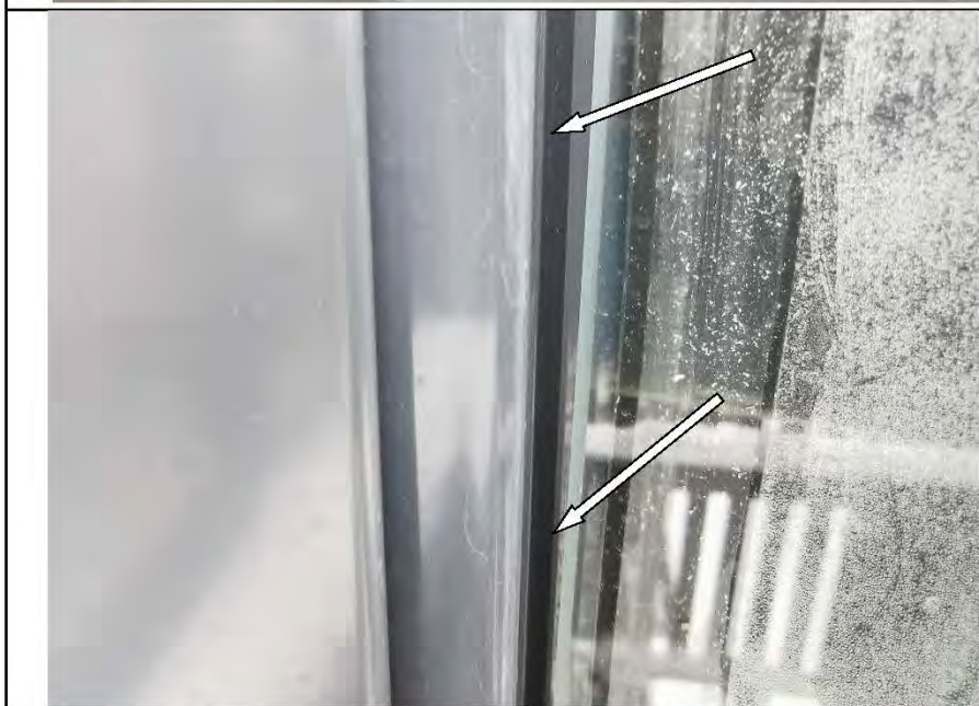
Фото №68. Отсутствует часть уплотняющей прокладки на металлическом оконном блоке на лоджии.
