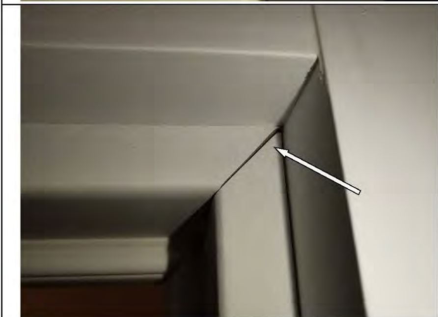
Фото №54. Элементы дверного блока (коробка) соединены не надежно в спальне.
