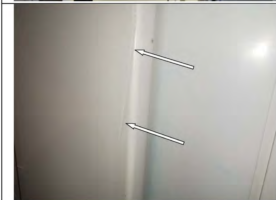
Фото №41. Царапины на профиле ПВХ дверного блока на кухне.
