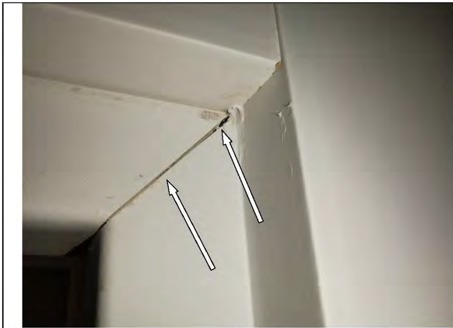
Фото №55. Элементы дверного блока (коробка) соединены не надежно на кухне.
