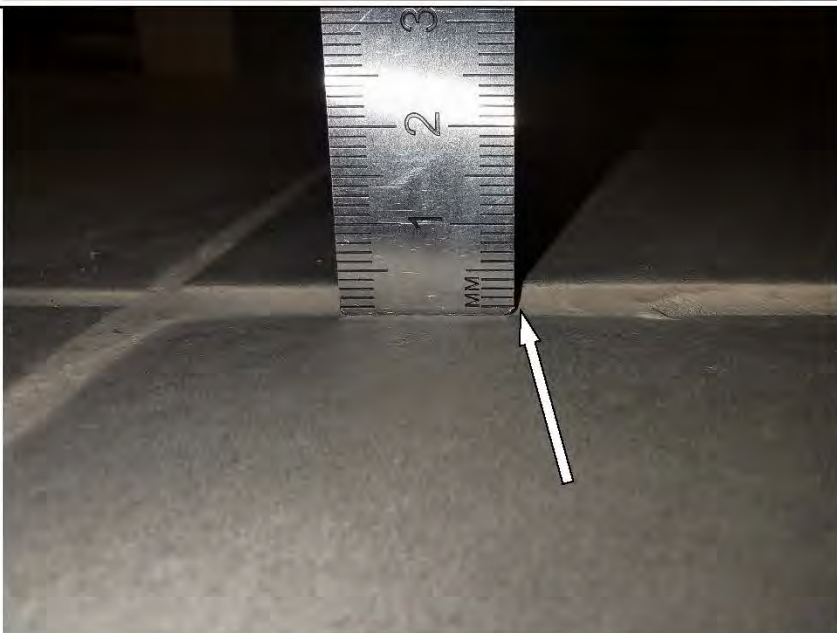
Фото №29. Уступы керамической плитки пола в ванной комнате.
