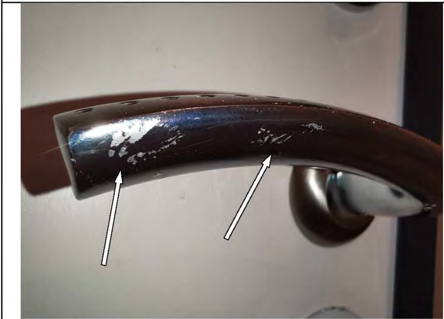
Фото №59. Царапины на фурнитуре входного дверного блока.
