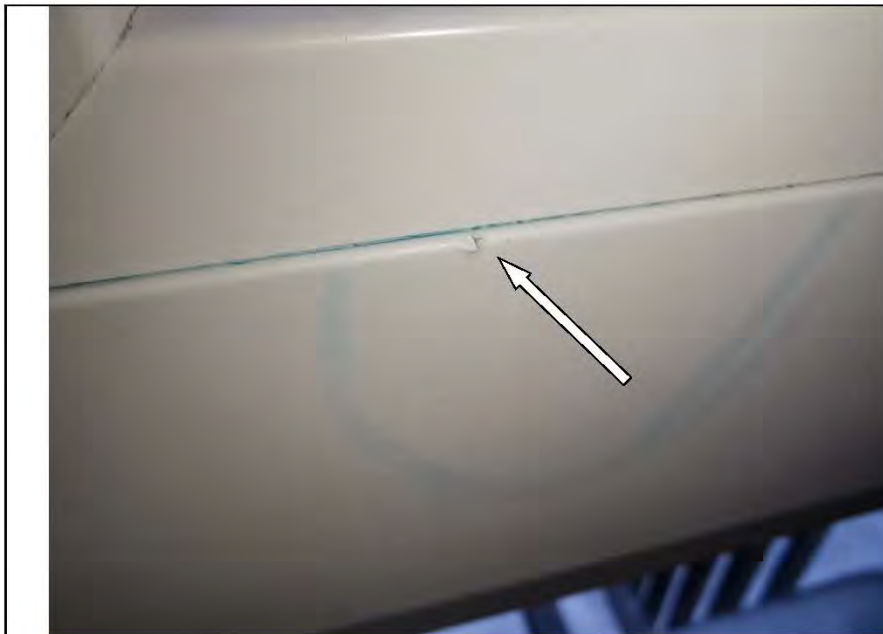
Фото №31. Скол на профиле ПВХ оконного блока в спальне.
