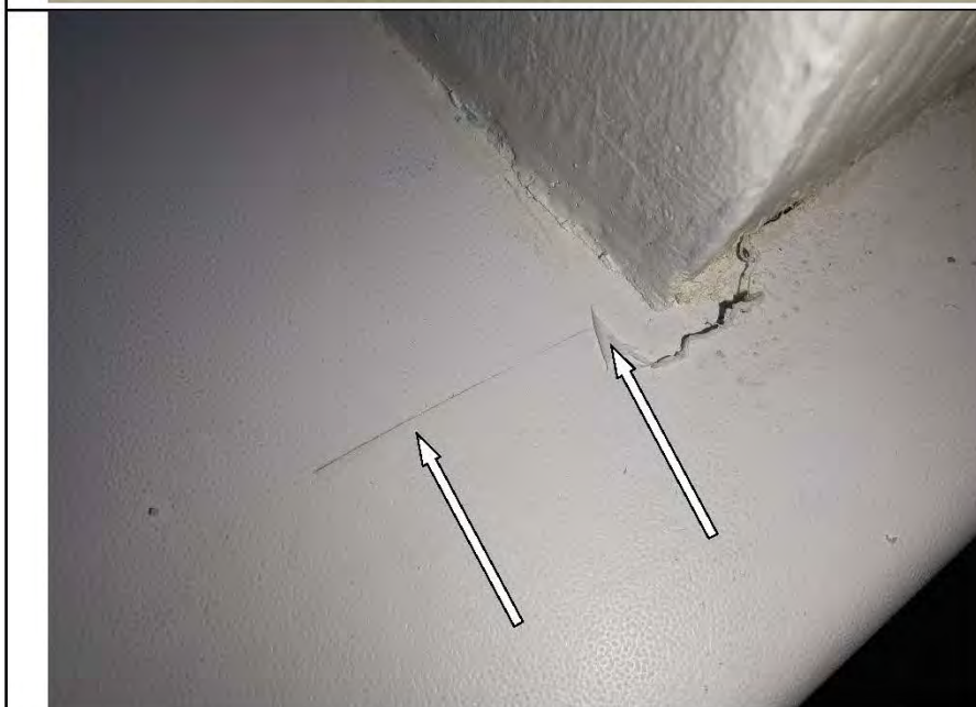
Фото №48. Царапины на лицевой поверхности подоконной доски оконного блока ПВХ в спальне.
