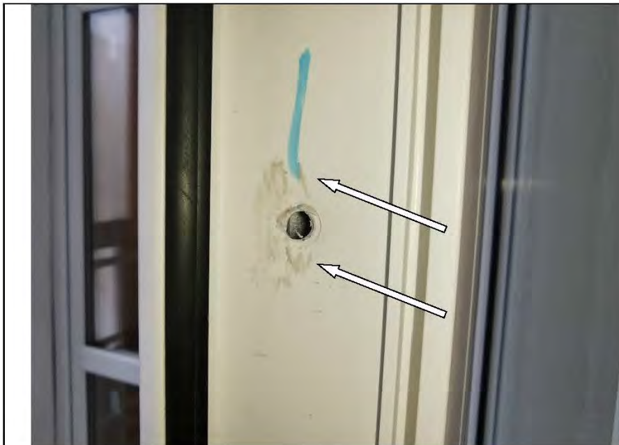
Фото №40. Потертости на профиле ПВХ дверного блока на кухне.
