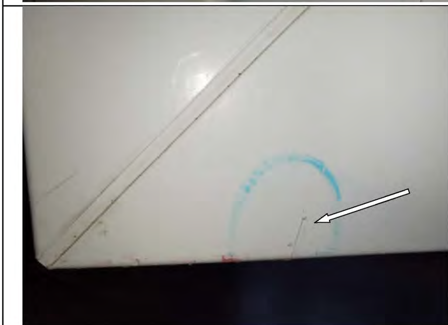
Фото №42. Царапины на профиле ПВХ дверного блока на кухне.
