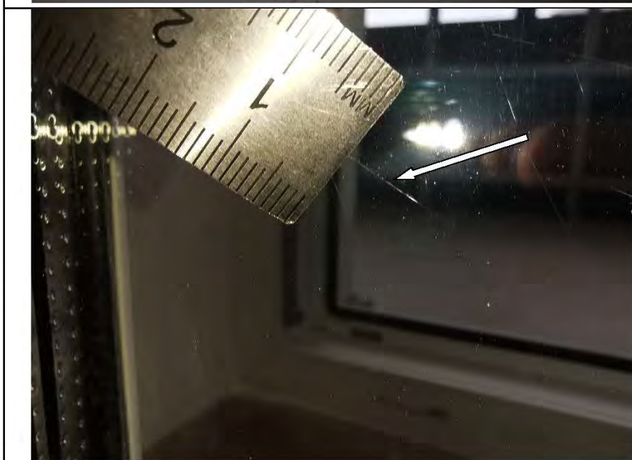
Фото №45. На стеклопакете дверного блока ПВХ на кухне имеются дефекты (царапины).
