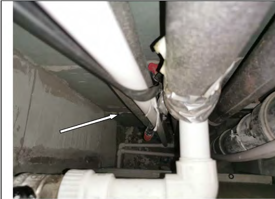
Фото №73. Трубы водоснабжения в шахте санузла не закреплены надлежащим образом.
