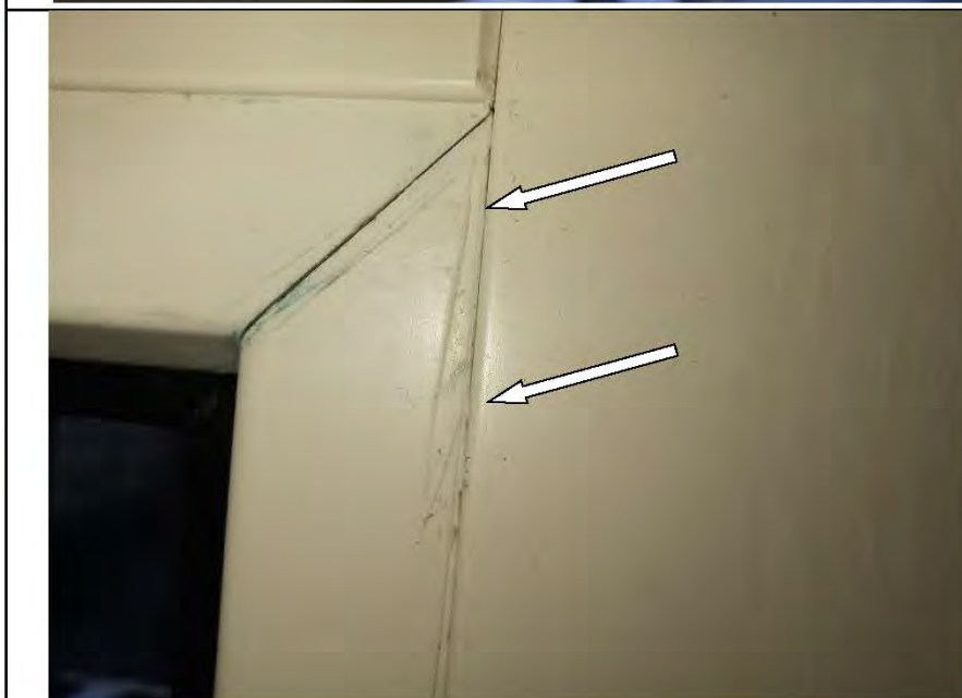
Фото №32. Царапины на профиле ПВХ оконного блока в спальне.
