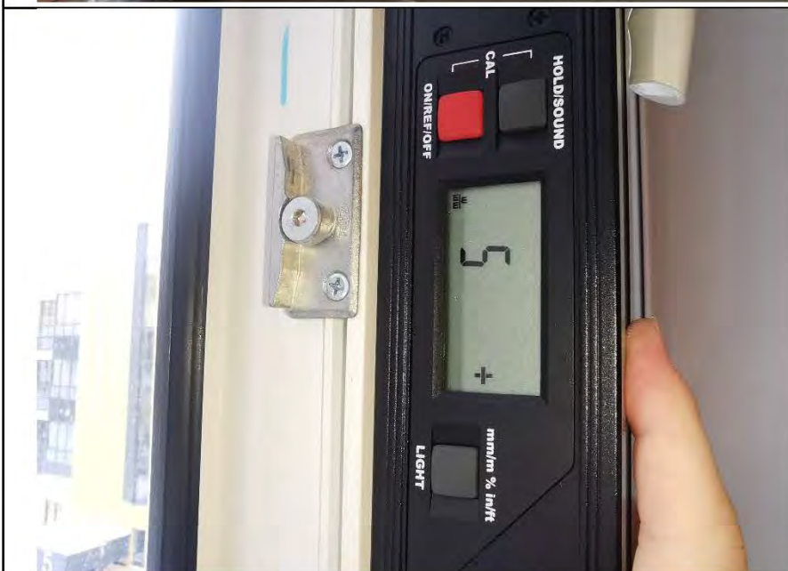
Фото №77. Отклонение ПВХ оконного блока по уровню вертикальности в спальне.
