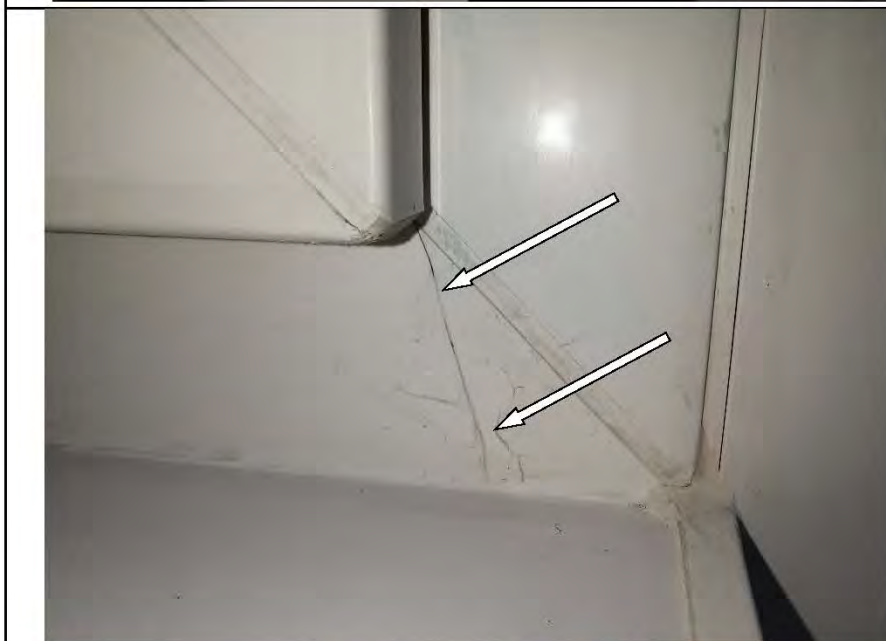
Фото №38. Трещина на профиле оконного блока ПВХ на кухне.
