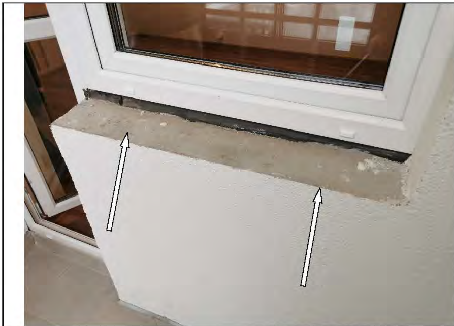
Фото №67. Не установлена подоконная доска на лоджии.
