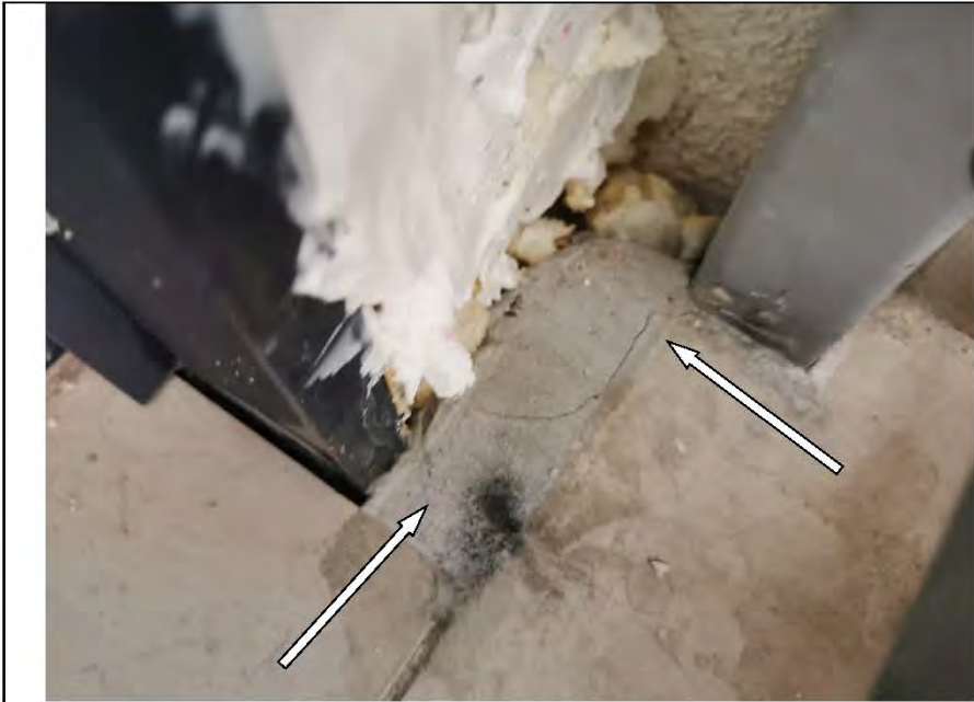
Фото №61. Коротко подрезана керамическая напольная плитка на лоджии.
