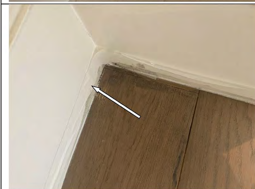
Фото №30. Дефект на напольном плинтусе ПВХ в спальне.
