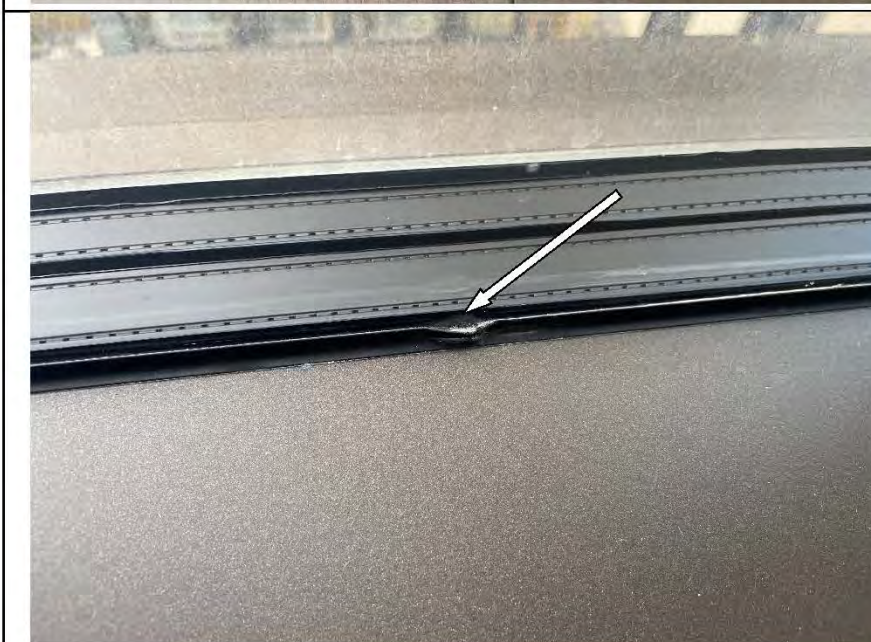
Фото №35. Дефект на алюминиевом профиле оконного блока в спальне.
