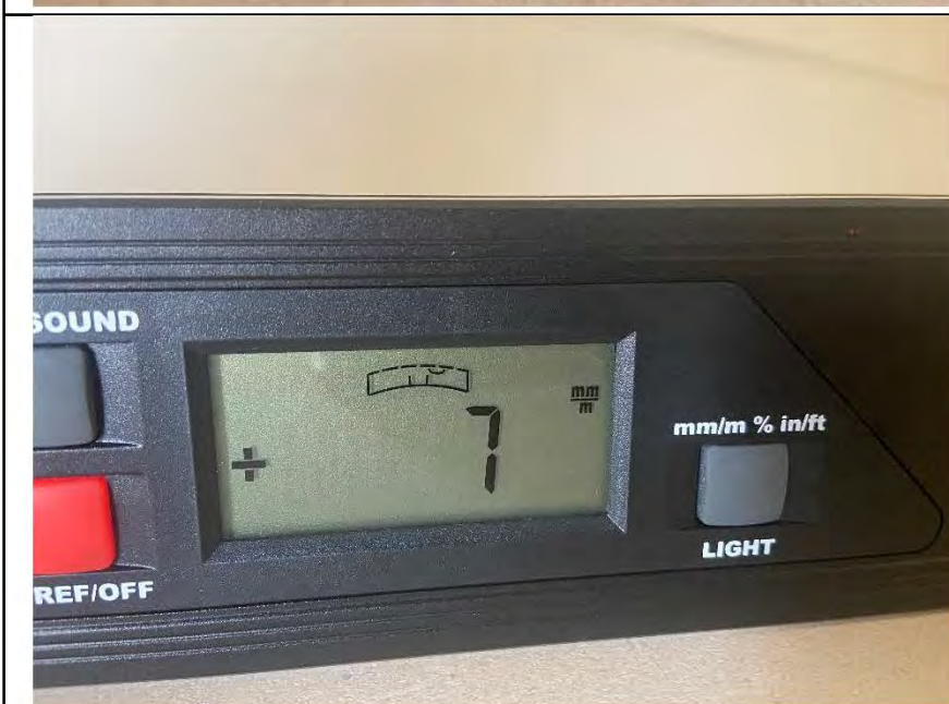
Фото №18. Отклонение поверхности напольного покрытия в коридоре.
