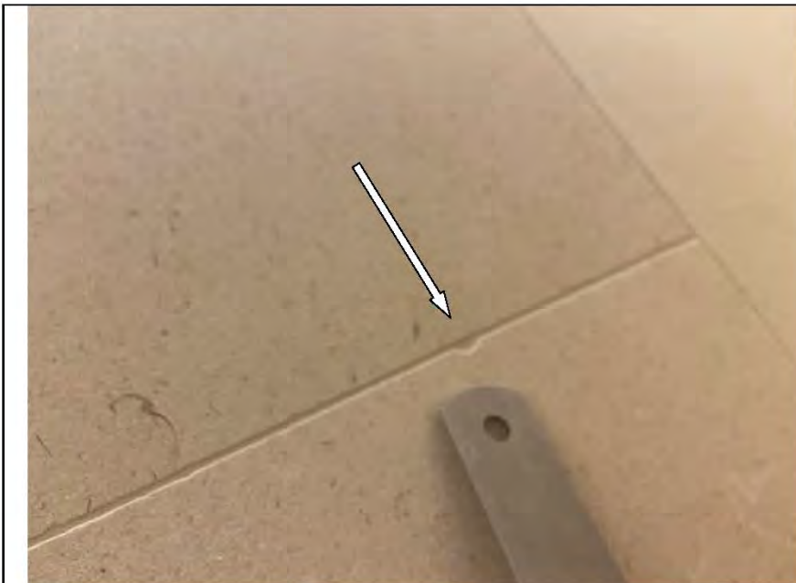
Фото №16. Сколы на напольной керамической плитке в ванной комнате.
