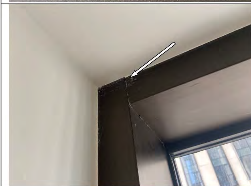
Фото №36. Дефект на алюминиевом профиле оконного блока в спальне.
