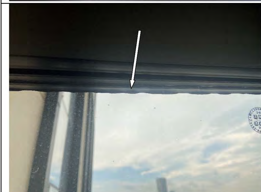
Фото №41. Дефект на уплотнительной ленте оконного блока в кухне.
