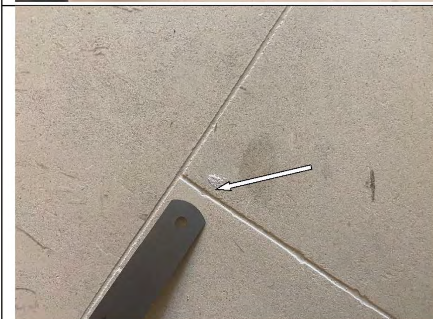
Фото №14. Сколы на напольной керамической плитке в коридоре.
