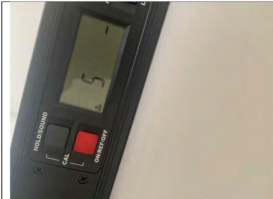
Фото №7. Отклонение поверхности стен от вертикали в спальне.
