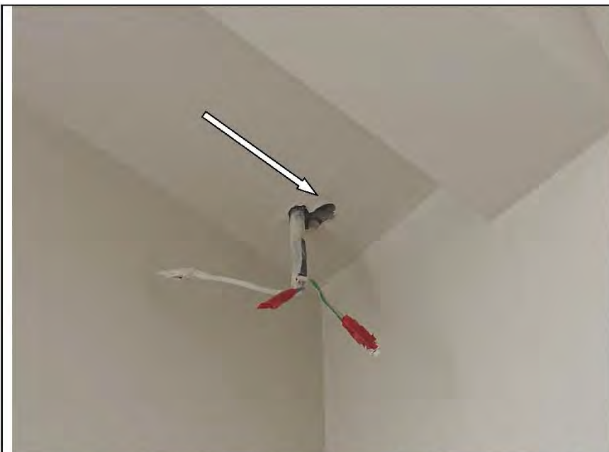
Фото №58. Дефект на поверхности окрашенного потолка в кухне.
