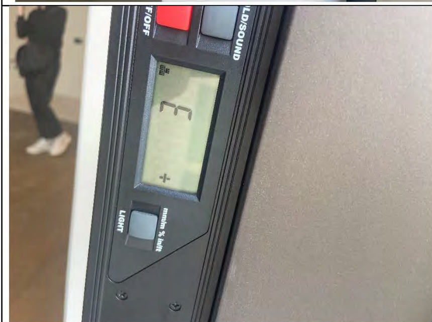
Фото №47. Отклонения от вертикали оконного блока в кухне.
