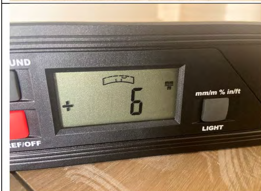
Фото №20. Отклонение поверхности напольного покрытия в кухне.
