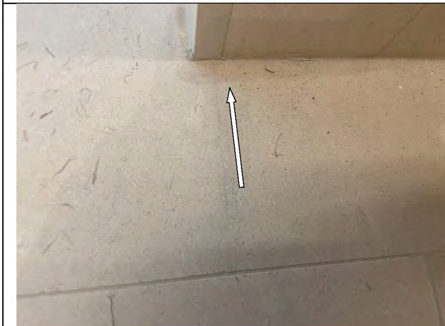
Фото №24. Загрязнения на напольной керамической плитке в ванной комнате.
