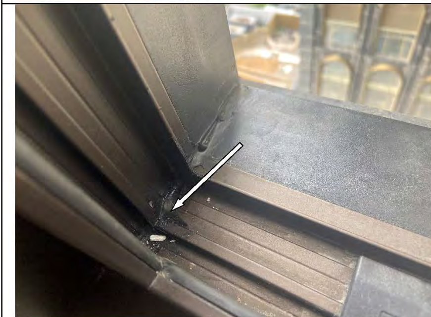
Фото №38. Дефект на алюминиевом профиле оконного блока в кухне.
