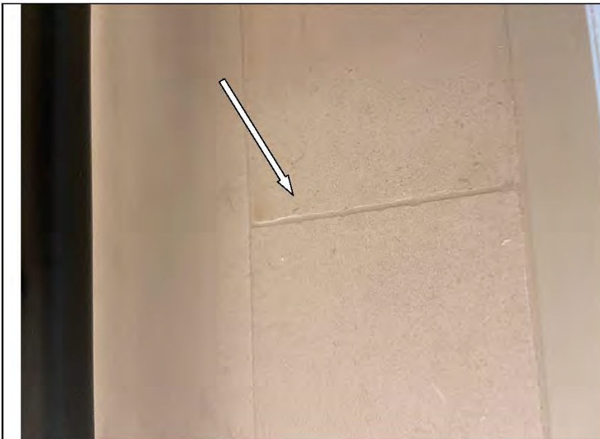
Фото №13. Неровные швы настенной керамической плитки в ванной комнате.
