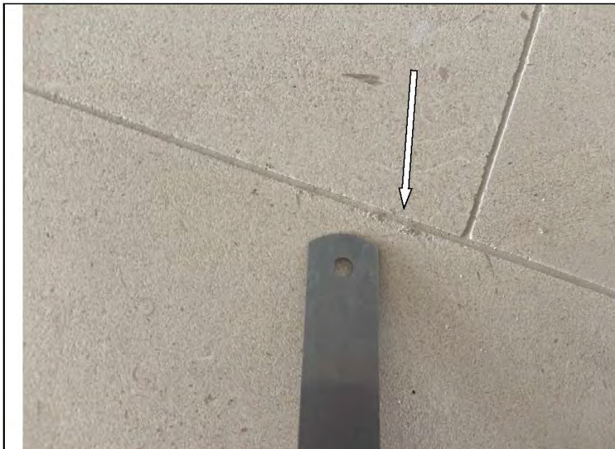
Фото №25. Неровные швы напольной керамической плитки в кухне.
