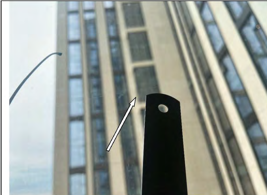
Фото №43. Царапина на стеклопакете алюминиевого оконного блока в спальне.
