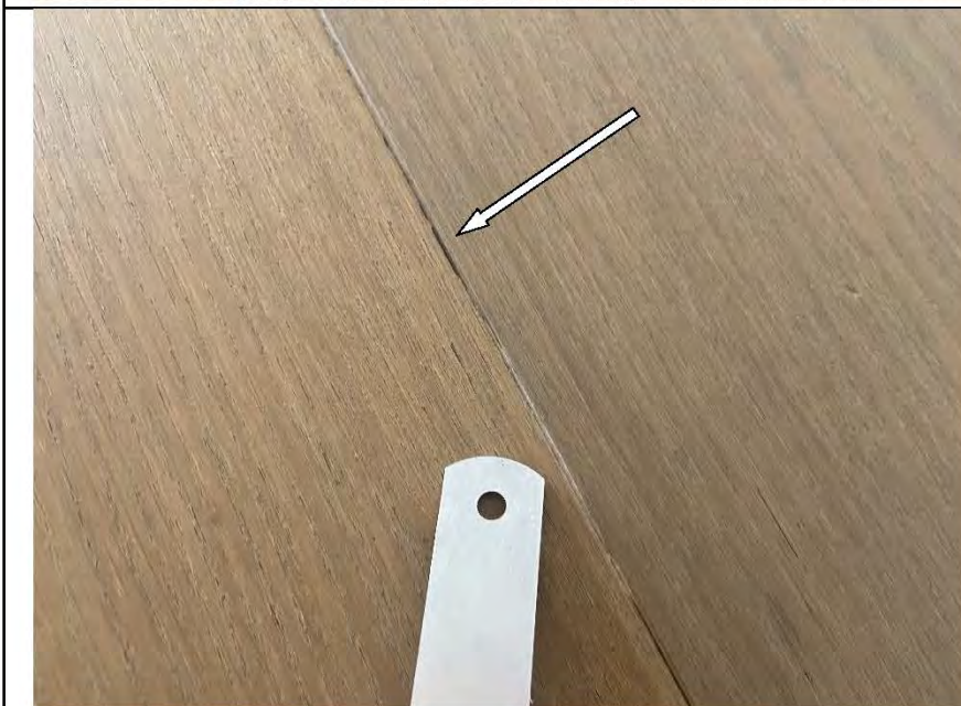
Фото №32. Дефект на напольном покрытии из паркетной доски в кухне.
