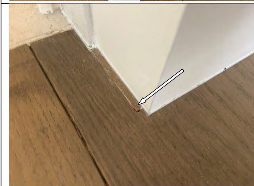
Фото №33. Дефект на напольном покрытии из паркетной доски в спальне.
