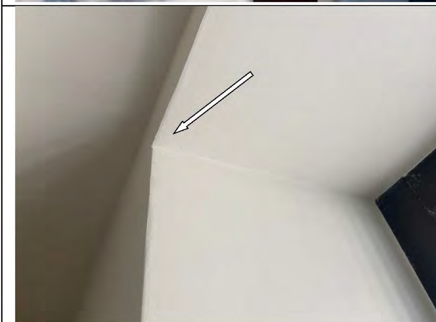
Фото №45. Неровности, выбоины на окрашенных откосах оконного блока в спальне.
