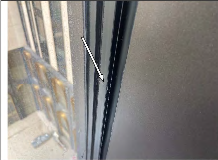
Фото №37. Дефект на алюминиевом профиле оконного блока в спальне.
