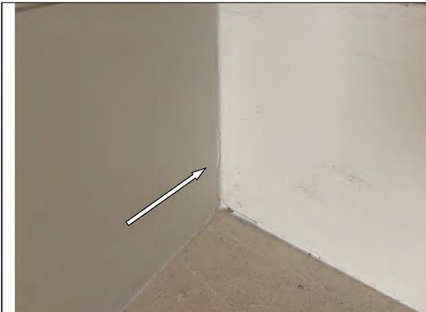
Фото №28. Дефект на напольном плинтусе ПВХ в коридоре.
