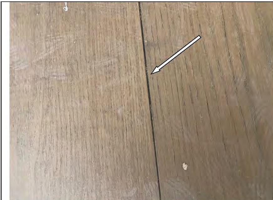
Фото №34. Дефект на напольном покрытии из паркетной доски в спальне.
