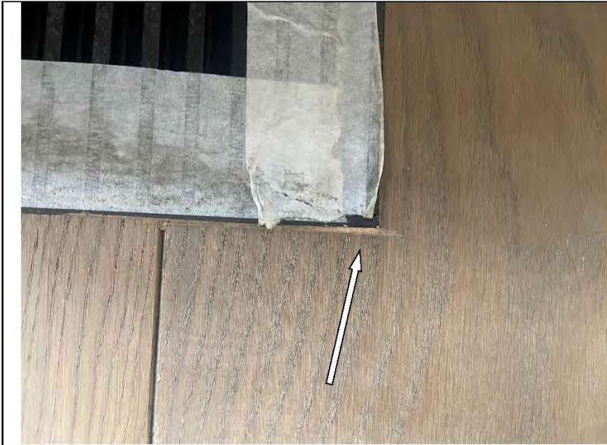
Фото №31. Дефект на напольном покрытии из паркетной доски в кухне.
