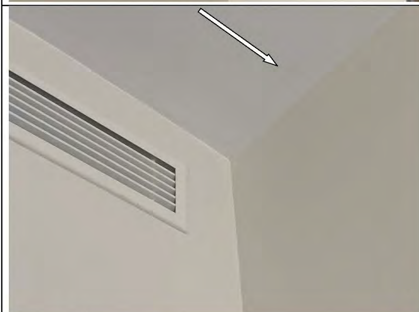
Фото №56. Дефект на поверхности окрашенного потолка в спальне.
