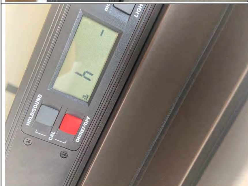
Фото №48. Отклонения от вертикали оконного блока в спальне.
