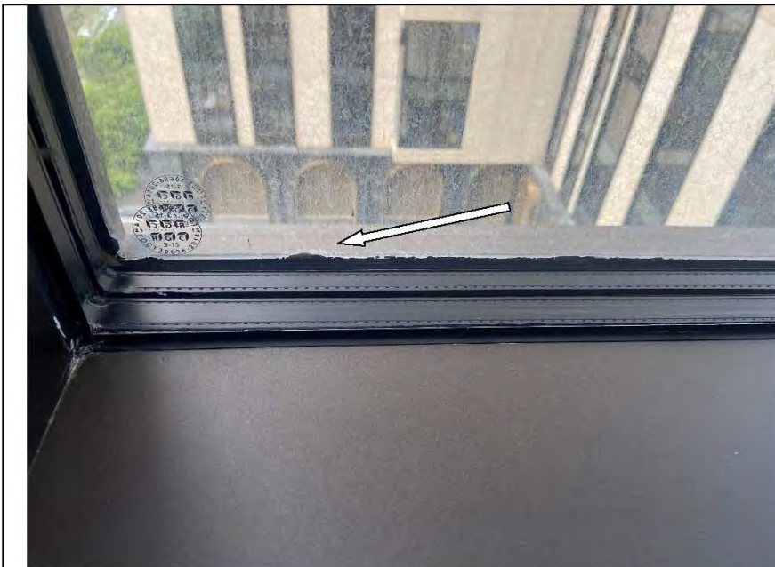
Фото №40. Дефект на уплотнительной ленте оконного блока в спальне.
