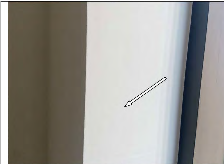
Фото №46. Неровности, выбоины на окрашенных откосах оконного блока в кухне.
