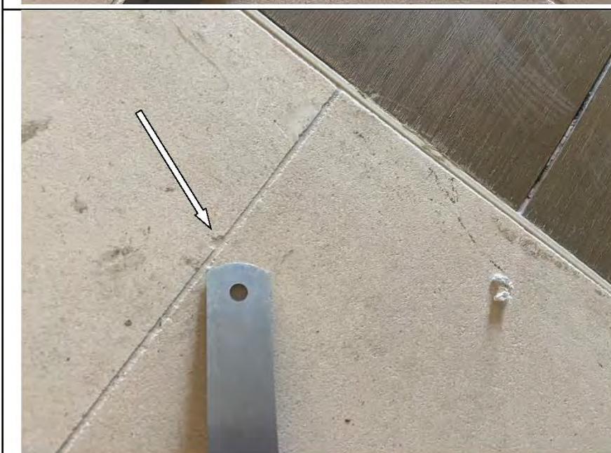
Фото №15. Сколы на напольной керамической плитке в коридоре.
