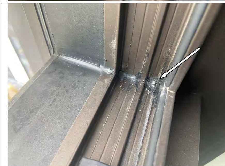
Фото №39. Дефект на алюминиевом профиле оконного блока в кухне.
