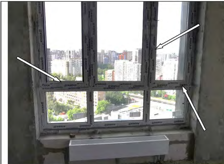
Фото №13. Не удалена защитная пленка с лицевой поверхности профилей оконного блока.
