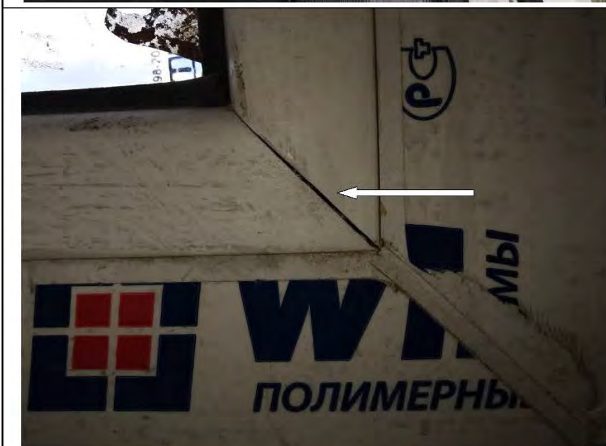
Фото №38. Зазор в месте стыка профилей ПВХ оконного блока 5.
