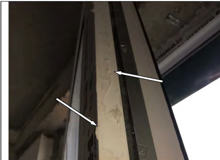
Фото №19. Загрязнение профиля ПВХ оконного блока 1.
