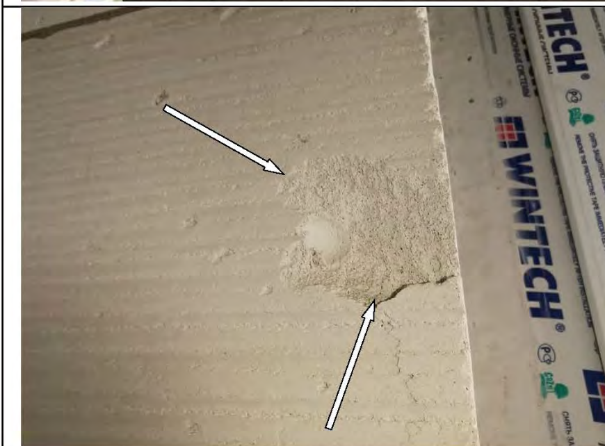
Фото №12. Неоднородность поверхности конструкции каменной кладки в помещении.
