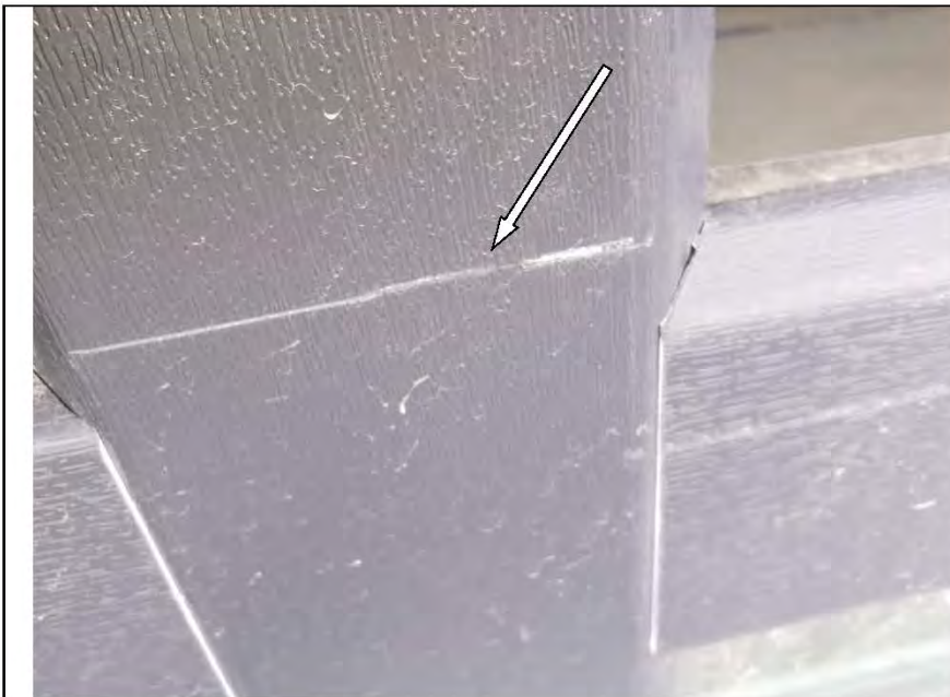
Фото №31. Потертости на профиле ПВХ оконного блока 3.
