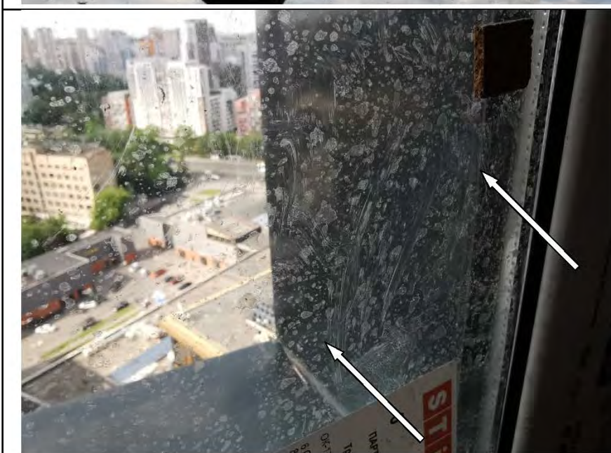
Фото №48. Загрязнение стеклопакета оконного блока 3.
