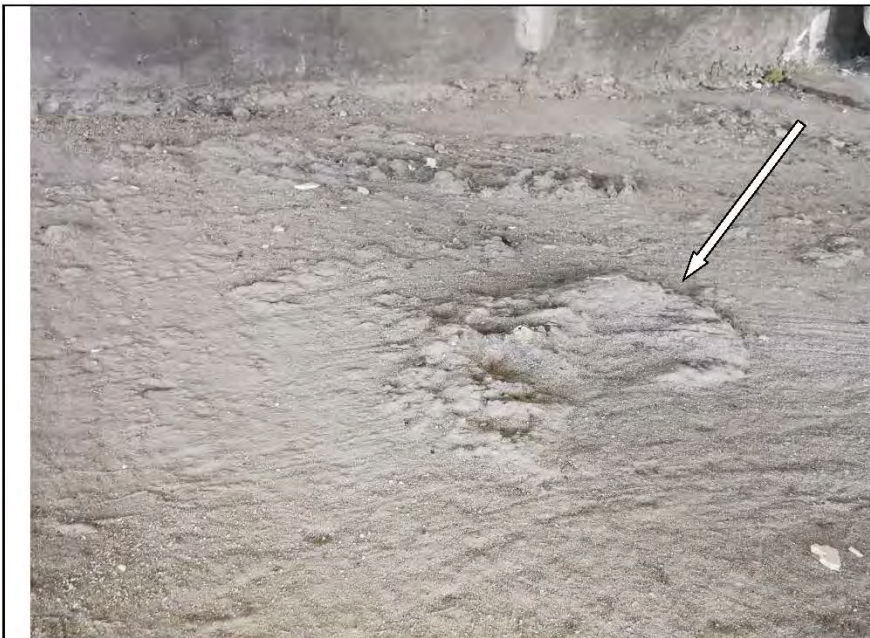
Фото №7. Неоднородность поверхности конструкции каменной кладки в помещении.
