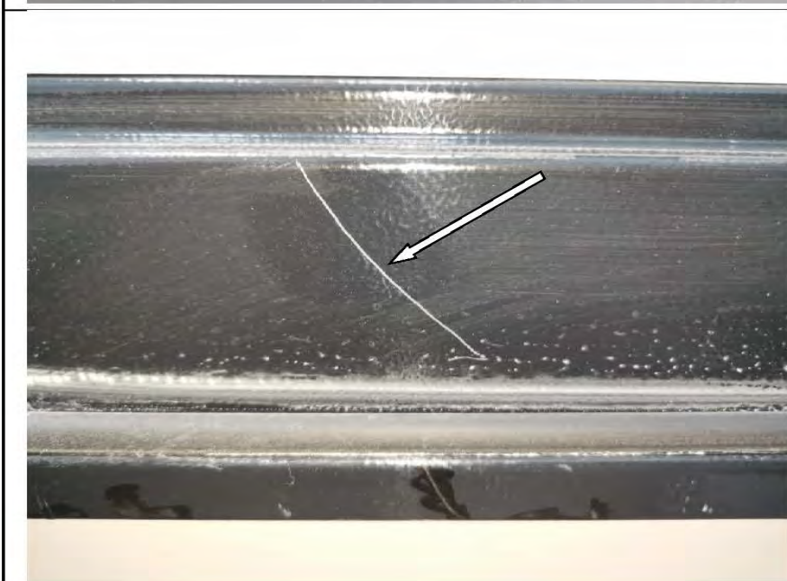
Фото №68. Механическое повреждение короба входного дверного блока.
