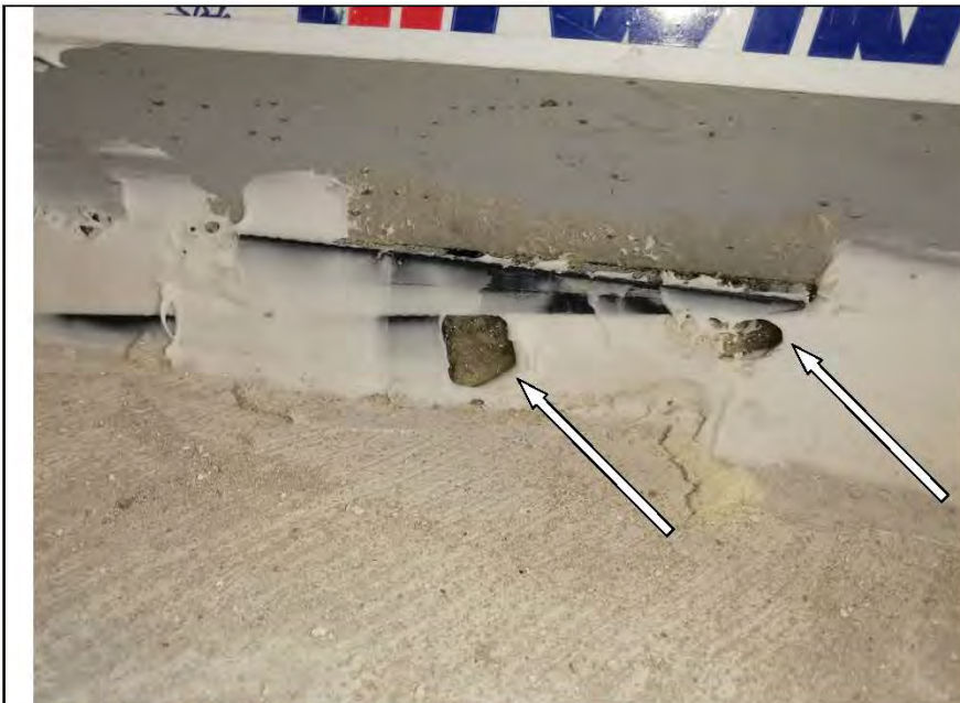
Фото №58. Некачественно выполнена герметизация узлов примыкания оконного блока 2.
