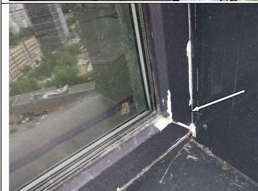
Фото №29. Загрязнение на профиле ПВХ оконного блока 3.
