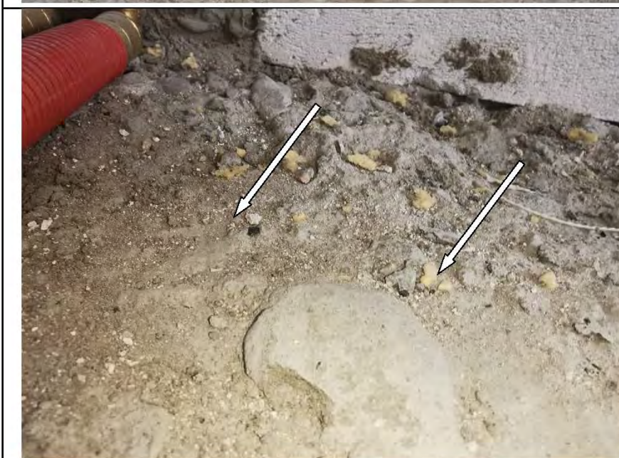
Фото №6. Разрушение конструкции кладки в квартире.
