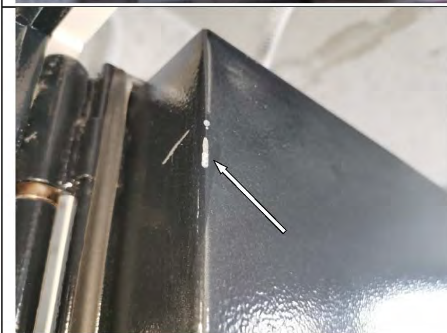
Фото №71. Механическое повреждение полотна входного дверного блока.
