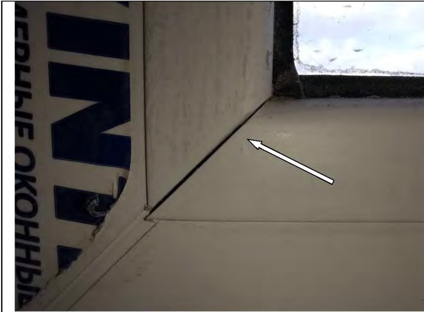
Фото №22. Зазор в месте стыка профилей ПВХ оконного блока 2.
