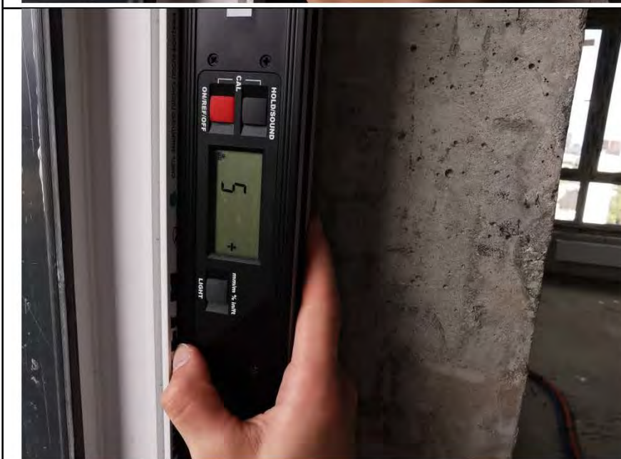
Фото №74. Отклонение ПВХ оконного блока 2 по уровню вертикальности.
