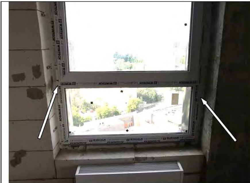
Фото №16. Не удалена защитная пленка с лицевой поверхности профилей оконного блока.
