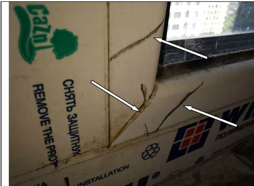
Фото №34. Зазор в месте стыка профилей ПВХ, загрязнение профиля ПВХ оконного блока 4.
