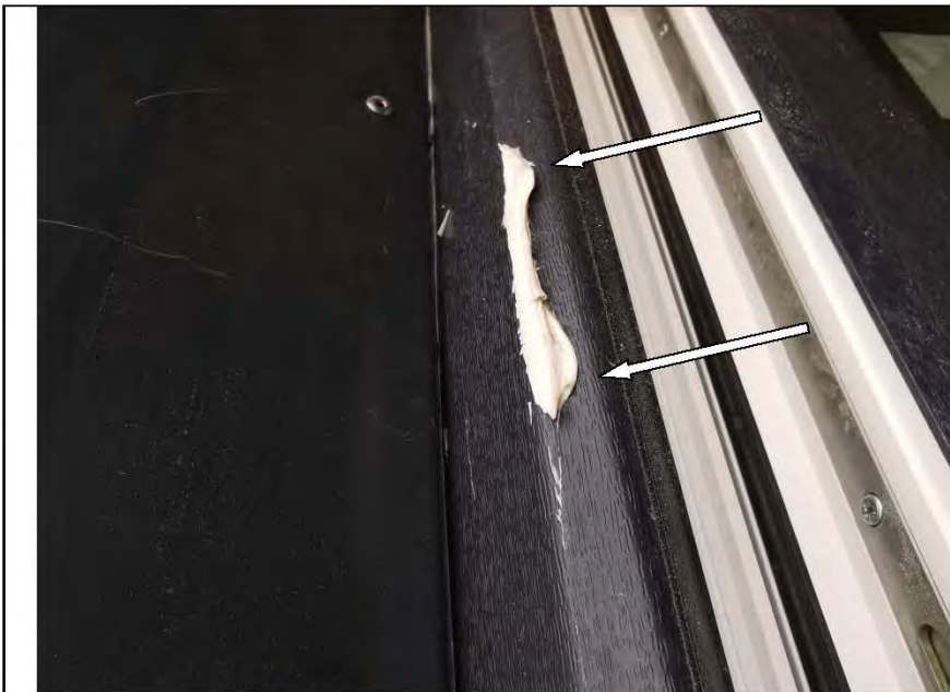
Фото №37. Отслоение ламинации на профиле ПВХ оконного блока 4.
