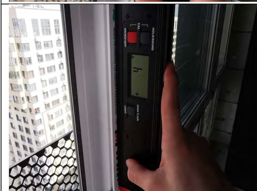
Фото №77. Отклонение ПВХ оконного блока 5 по уровню вертикальности.
