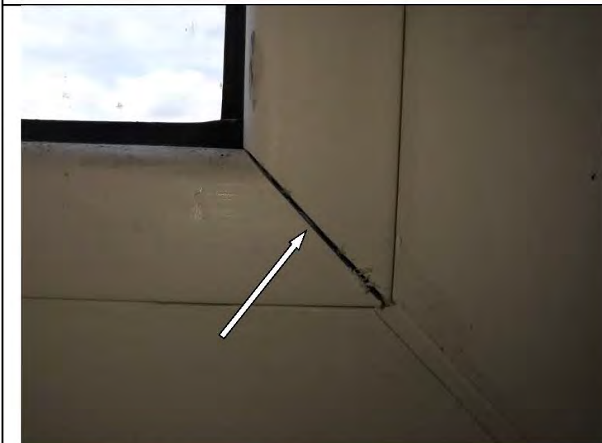
Фото №23. Зазор в месте стыка профилей ПВХ оконного блока 2.
