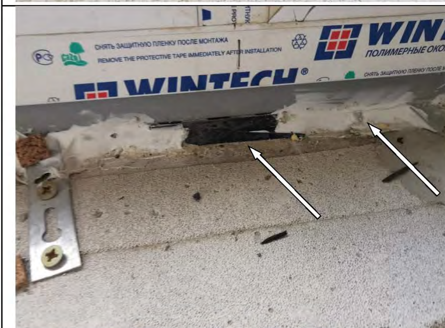
Фото №61. Некачественно выполнена герметизация узлов примыкания оконного блока 4.
