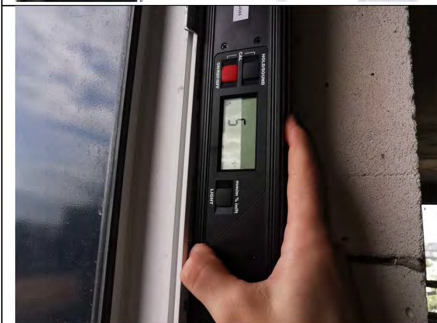
Фото №73. Отклонение ПВХ оконного блока 1 по уровню вертикальности.
