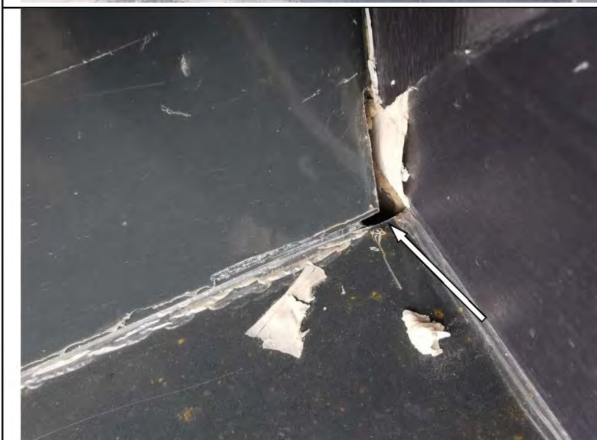
Фото №64. Дефект установки металлического отлива оконного блока 3.
