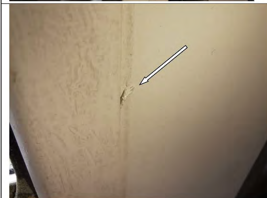
Фото №21. Потертости на профиле ПВХ оконного блока 1.
