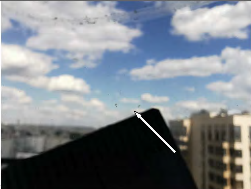
Фото №55. Окалины на стеклопакете оконного блока 5.
