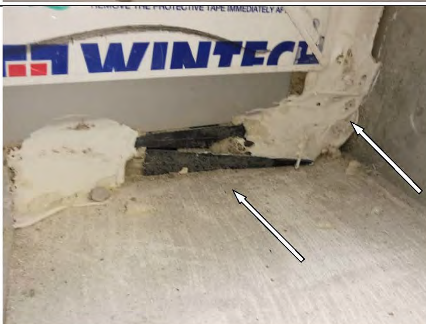
Фото №57. Некачественно выполнена герметизация узлов примыкания оконного блока 2.
