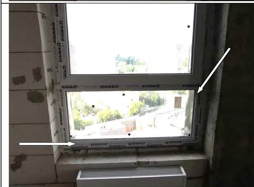
Фото №17. Не удалена защитная пленка с лицевой поверхности профилей оконного блока.
