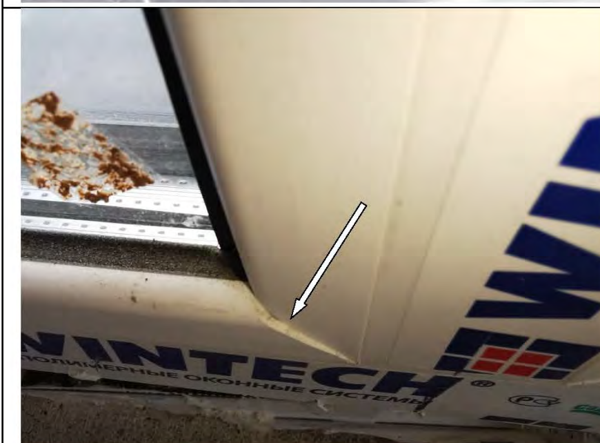
Фото №32. Зазор в месте стыка профилей ПВХ оконного блока 3.
