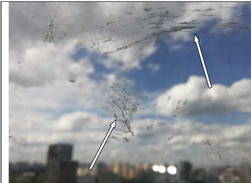
Фото №46. Загрязнение стеклопакета оконного блока 2.
