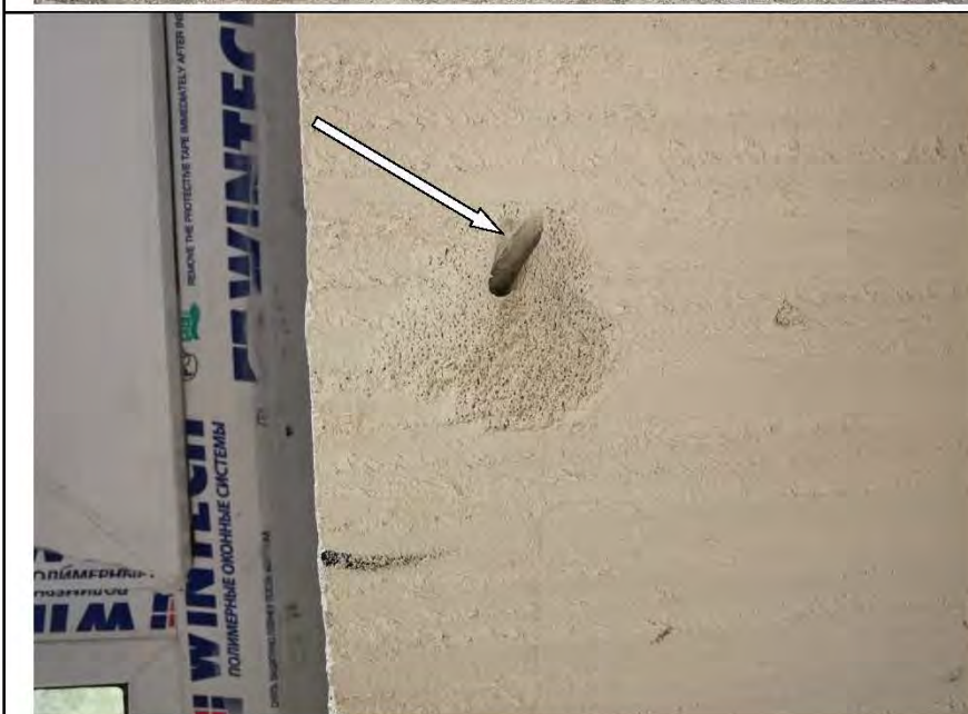
Фото №8. Неоднородность поверхности конструкции каменной кладки в помещении.
