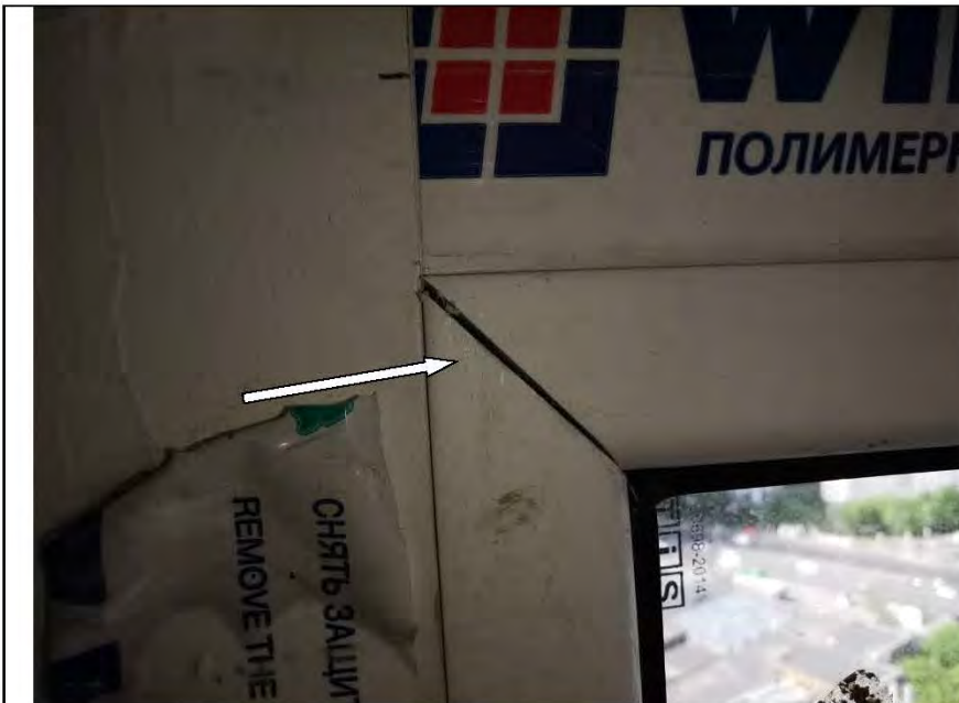
Фото №28. Зазор в месте стыка профилей ПВХ оконного блока 3.
