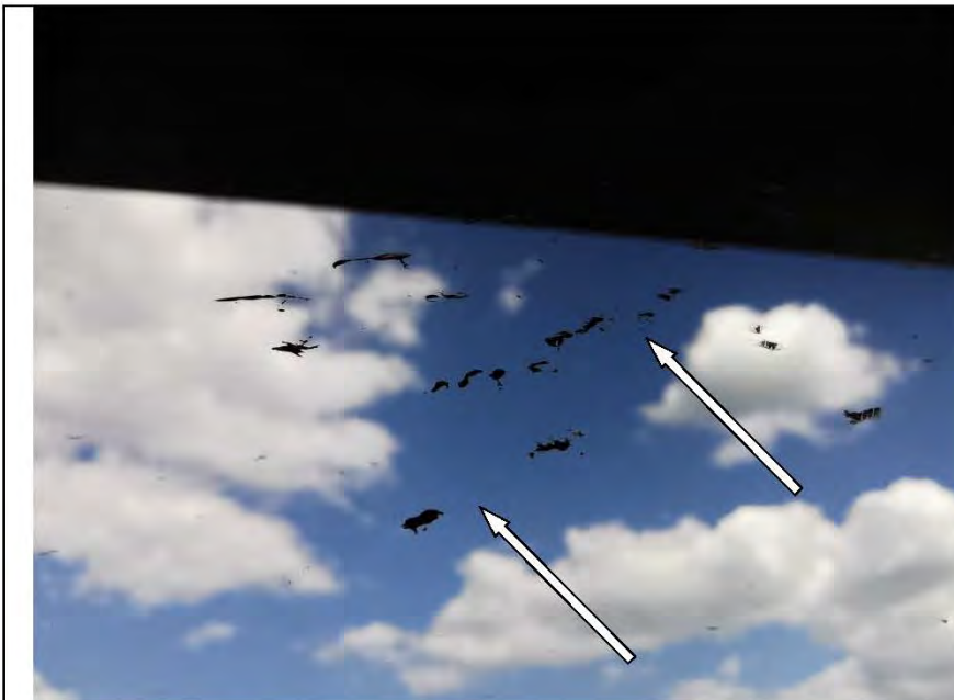
Фото №52. Загрязнение стеклопакета оконного блока 4.
