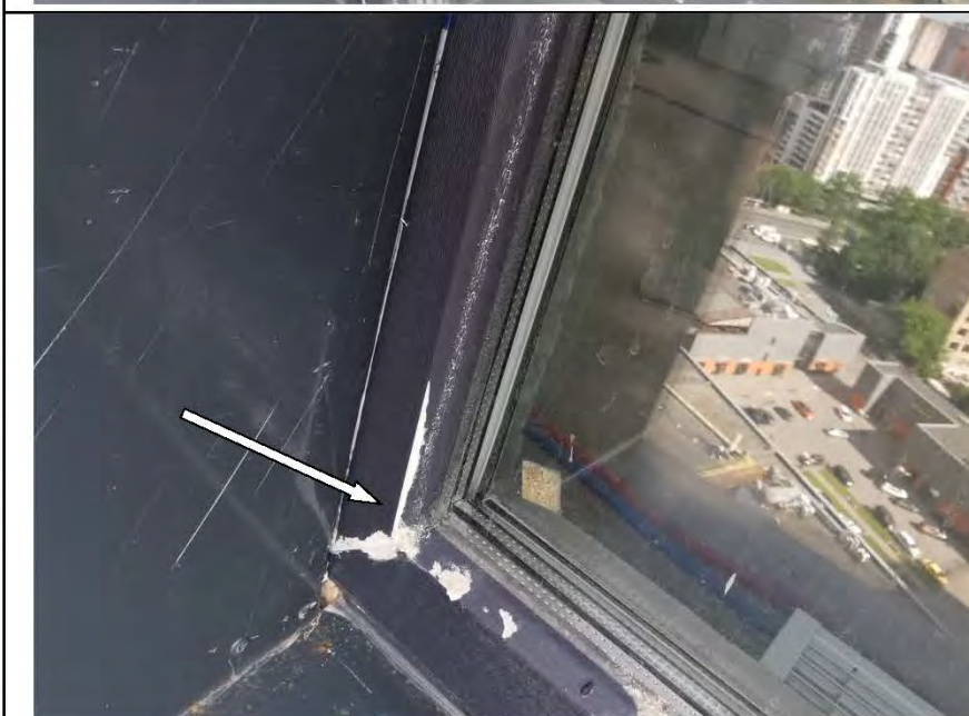
Фото №26. Загрязнение профиля ПВХ оконного блока 2.
