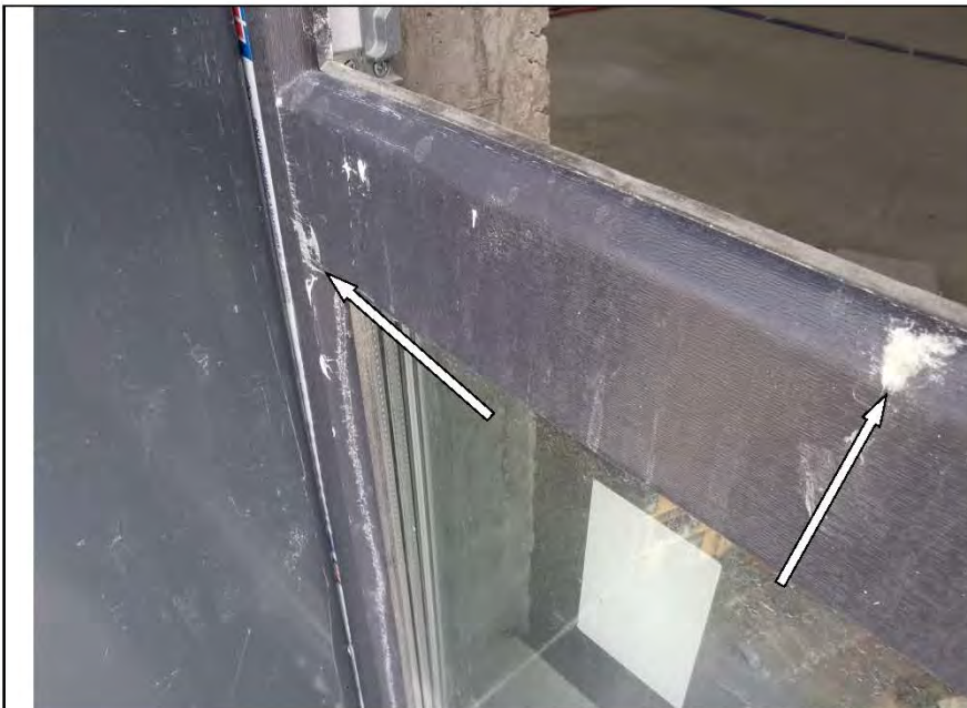
Фото №25. Загрязнение профиля ПВХ оконного блока 2.
