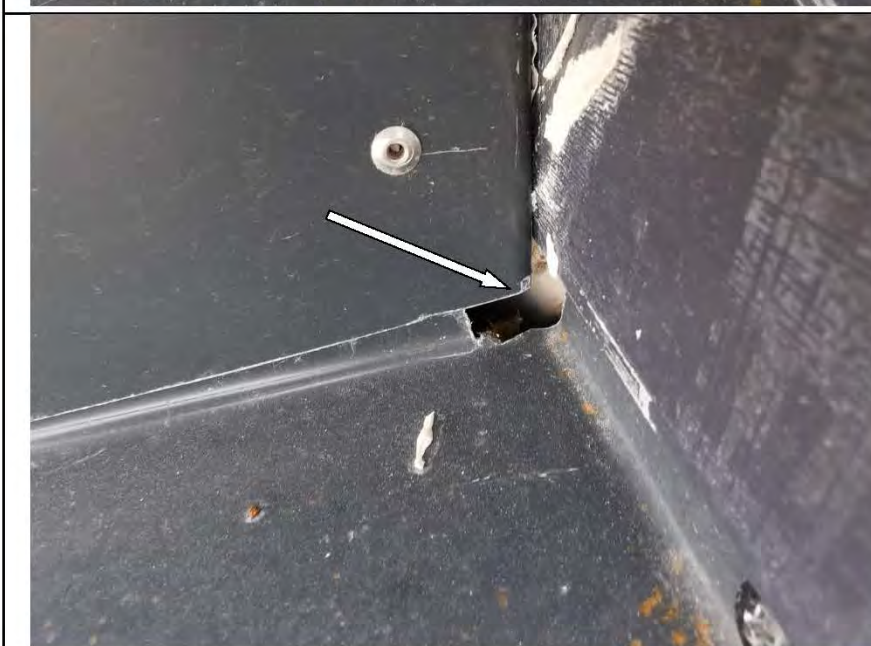
Фото №65. Дефект установки металлического отлива оконного блока 4.
