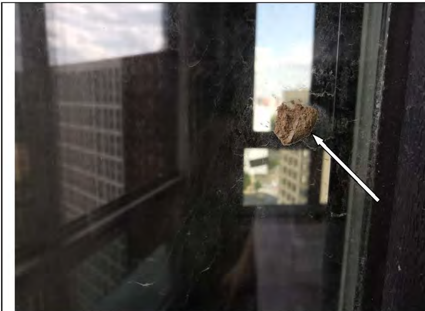
Фото №49. Загрязнение стеклопакета оконного блока 23.
