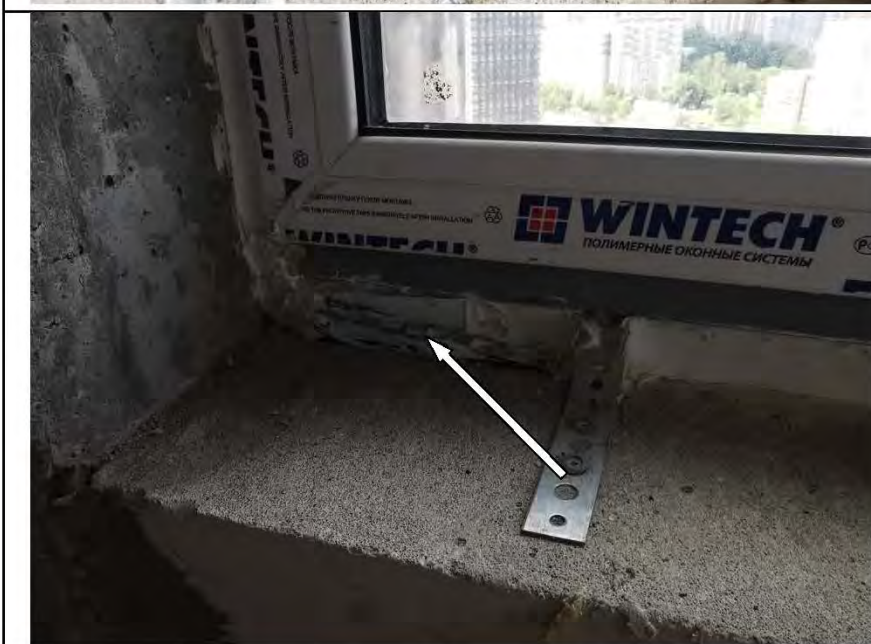
Фото №60. Некачественно выполнена герметизация узлов примыкания оконного блока 3.
