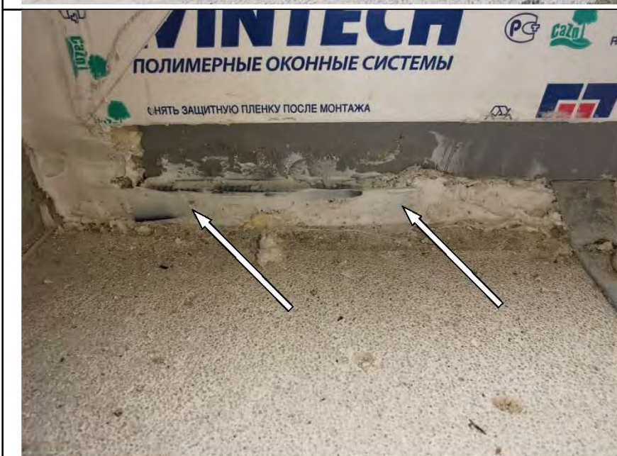
Фото №62. Некачественно выполнена герметизация узлов примыкания оконного блока 5.
