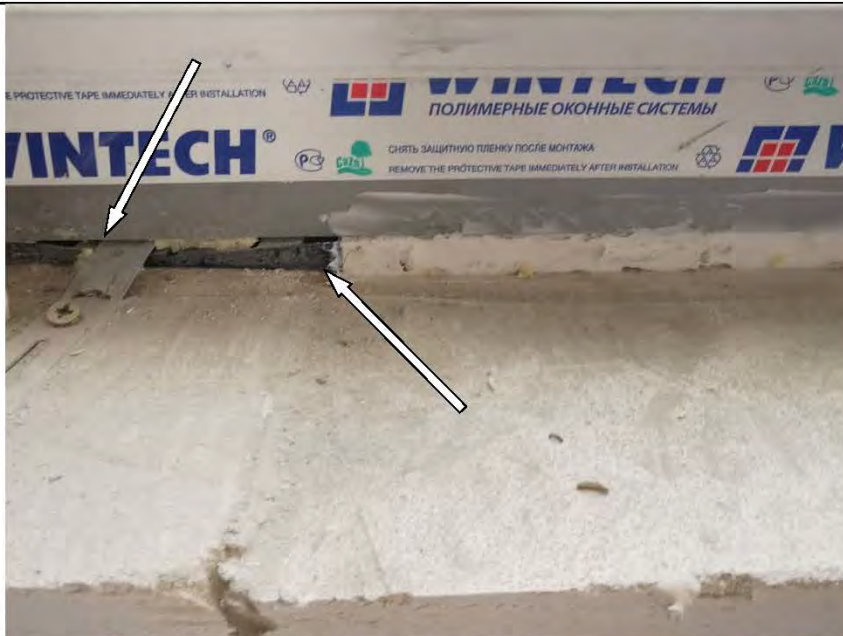
Фото №56. Некачественно выполнена герметизация узлов примыкания оконного блока 1.
