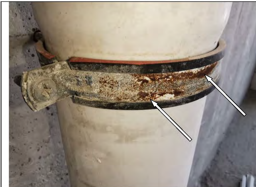
Фото №78. Коррозия на креплении трубы канализации.
