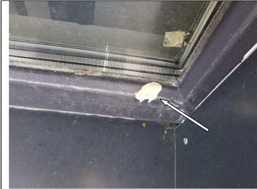
Фото №40. Загрязнение на профиле ПВХ оконного блока 5.
