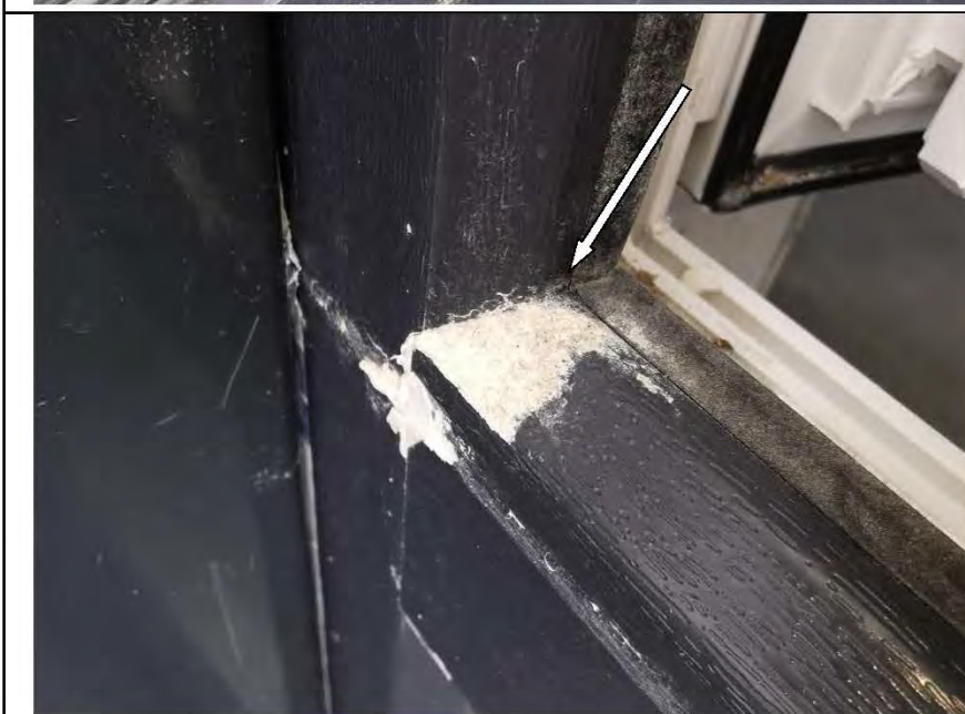
Фото №30. Загрязнение на профиле ПВХ оконного блока 3.
