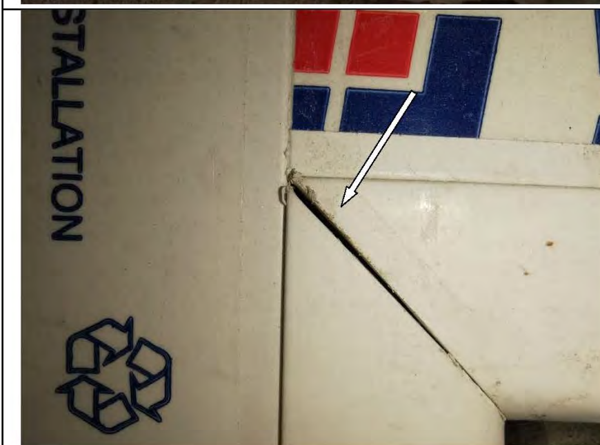
Фото №33. Зазор в месте стыка профилей ПВХ оконного блока 4.
