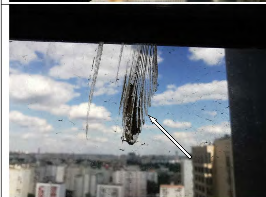
Фото №54. Загрязнение стеклопакета оконного блока 5.
