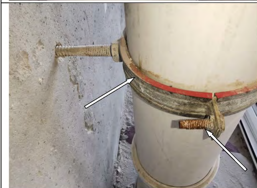
Фото №80. Коррозия на креплении трубы канализации.
