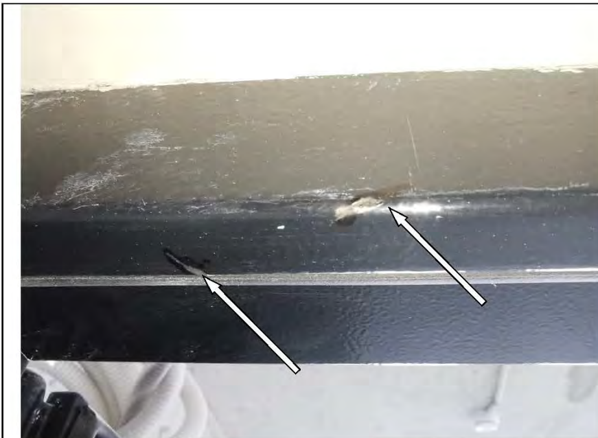
Фото №69. Механическое повреждение короба входного дверного блока.
