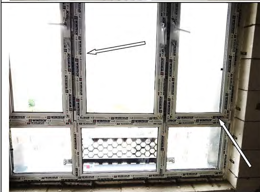
Фото №15. Не удалена защитная пленка с лицевой поверхности профилей оконного блока.
