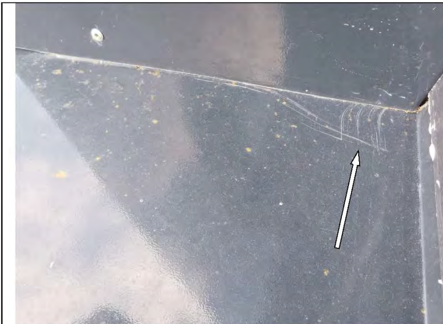
Фото №63. Царапины на металлическом отливе оконного блока 1.
