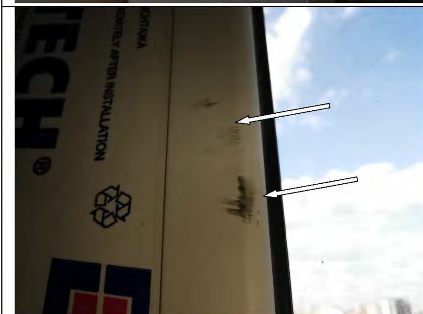
Фото №18. Загрязнение профиля ПВХ оконного блока 1.
