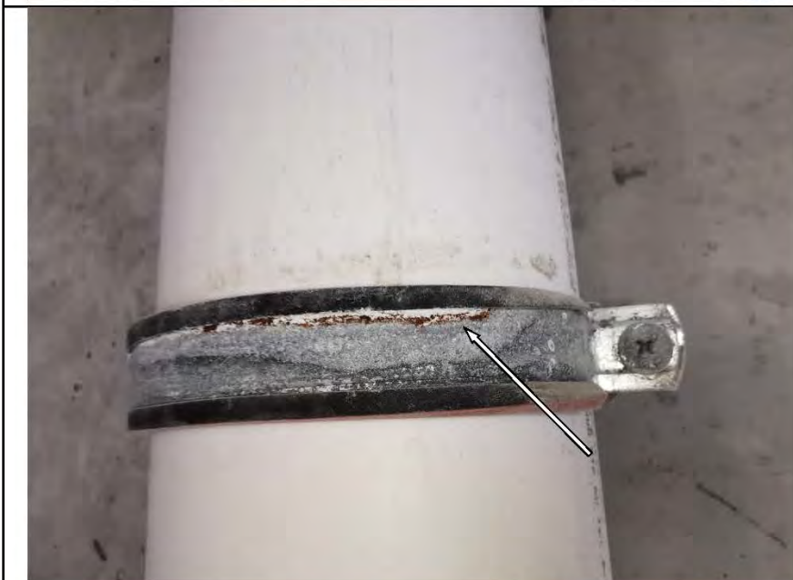
Фото №79. Коррозия на креплении трубы канализации.
