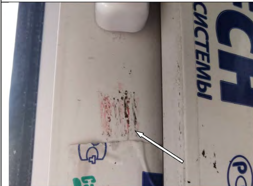
Фото №41. Загрязнение на профиле ПВХ оконного блока 5.
