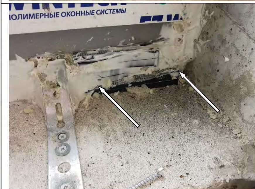
Фото №59. Некачественно выполнена герметизация узлов примыкания оконного блока 3.
