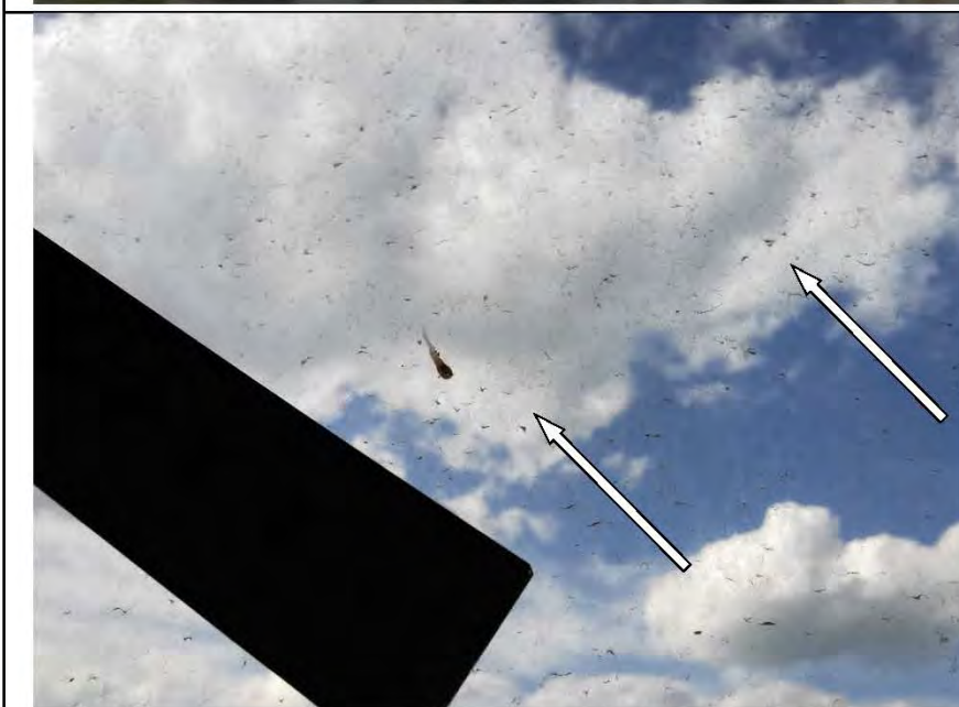
Фото №47. Загрязнение стеклопакета оконного блока 2.
