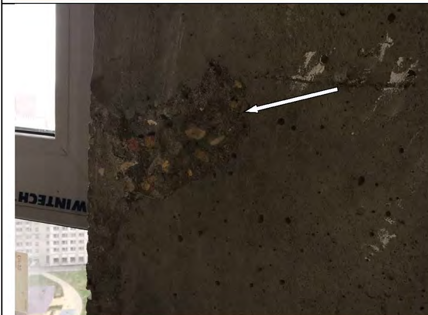
Фото №11. Неоднородность поверхности конструкции каменной кладки в помещении.
