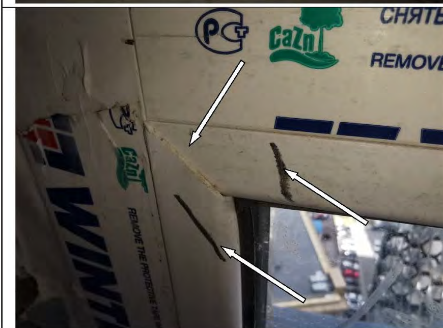
Фото №39. Зазор в месте стыка профилей ПВХ, загрязнение профиля ПВХ оконного блока 5.
