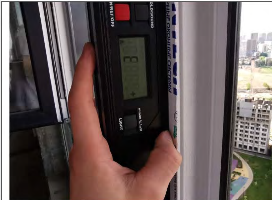
Фото №75. Отклонение ПВХ оконного блока 3 по уровню вертикальности.
