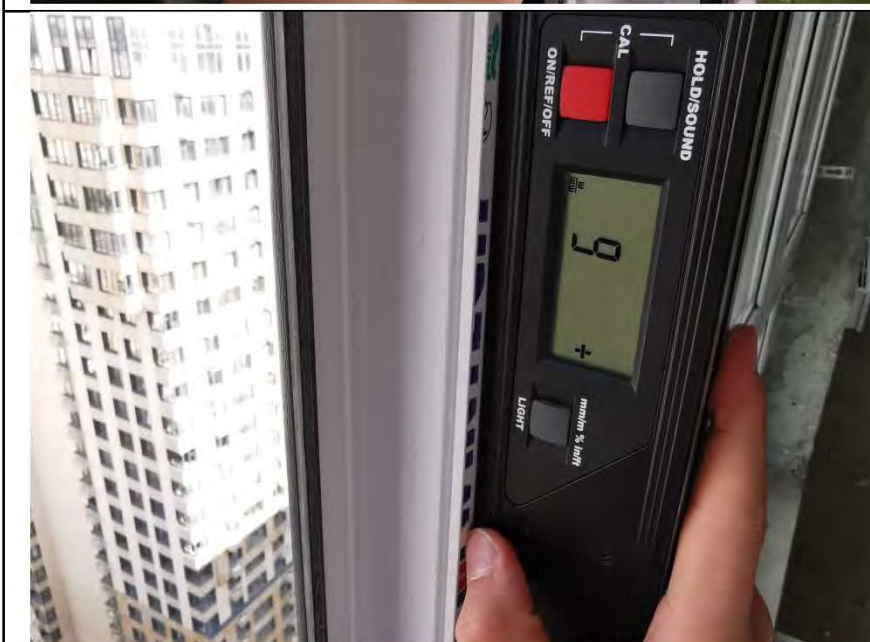
Фото №76. Отклонение ПВХ оконного блока 4 по уровню вертикальности.
