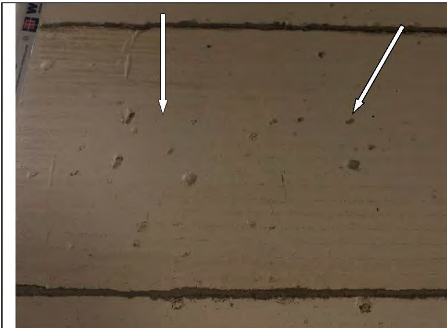
Фото №10. Неоднородность поверхности конструкции каменной кладки в помещении.
