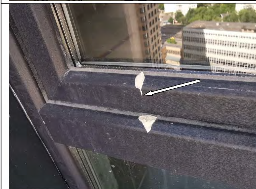
Фото №35. Загрязнение на профиле ПВХ оконного блока 4.
