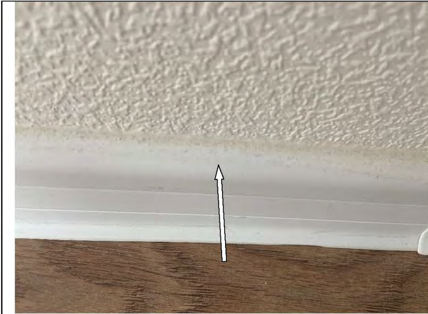
Фото №31. Дефекты на напольном плинтусе ПВХ в спальне.
