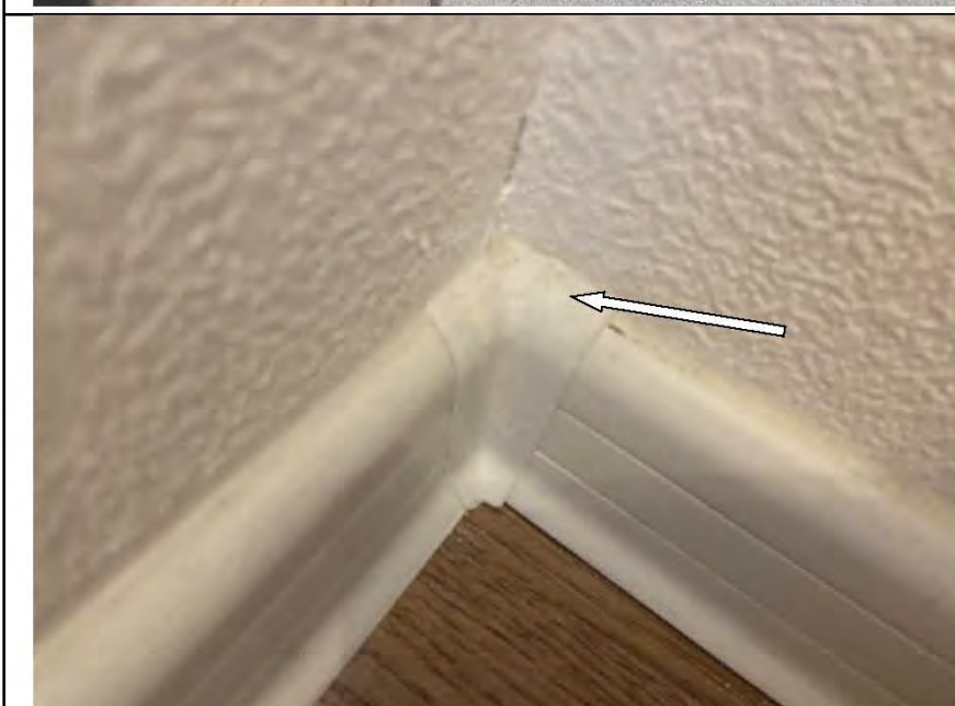
Фото №29. Дефекты на напольном плинтусе ПВХ в коридоре.
