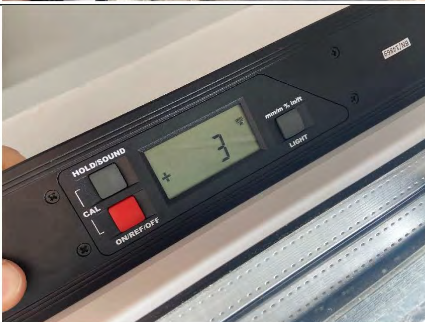
Фото №60. Отклонение оконного блока ПВХ по уровню вертикальности в спальне.
