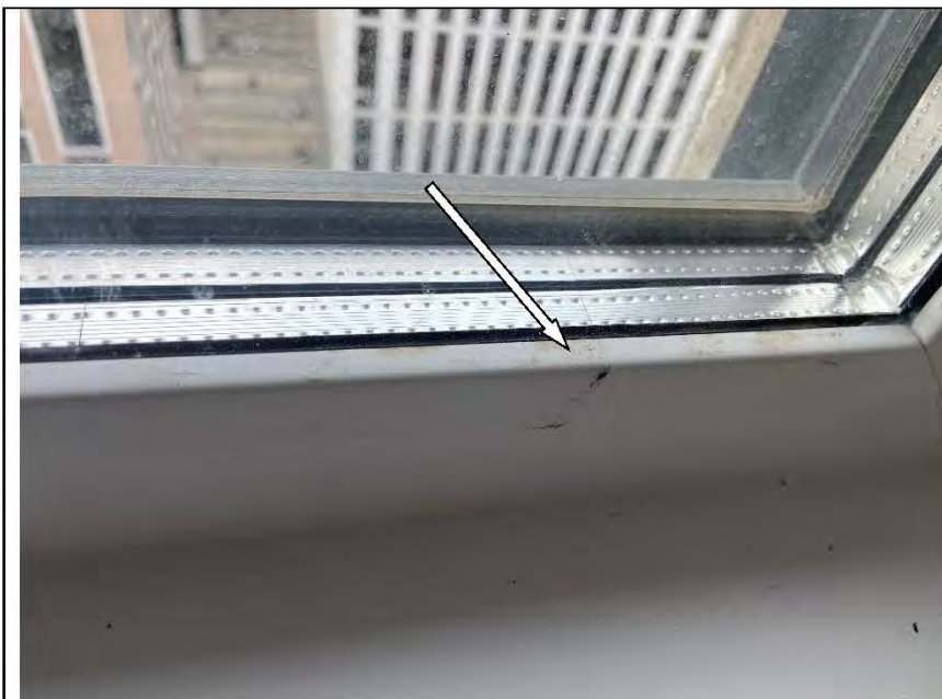
Фото №49. Загрязнения на профиле оконного блока ПВХ в спальне.
