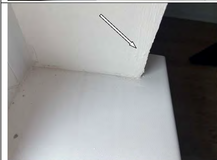
Фото №47. Неровности, выбоины, подтеки на окрашенных откосах оконного блока ПВХ в кухне.
