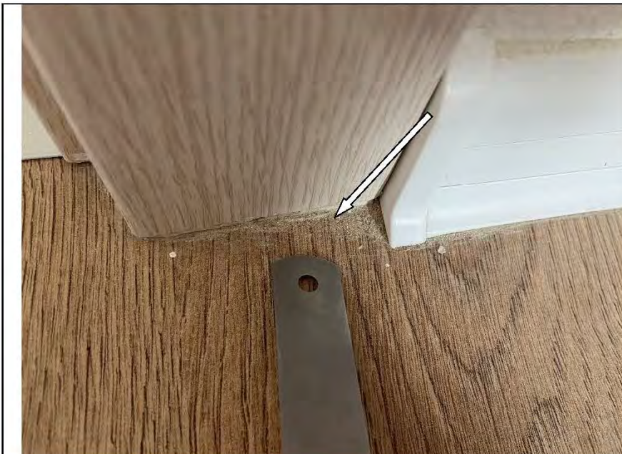
Фото №37. Загрязнения на напольном покрытии из ламината в кухне.
