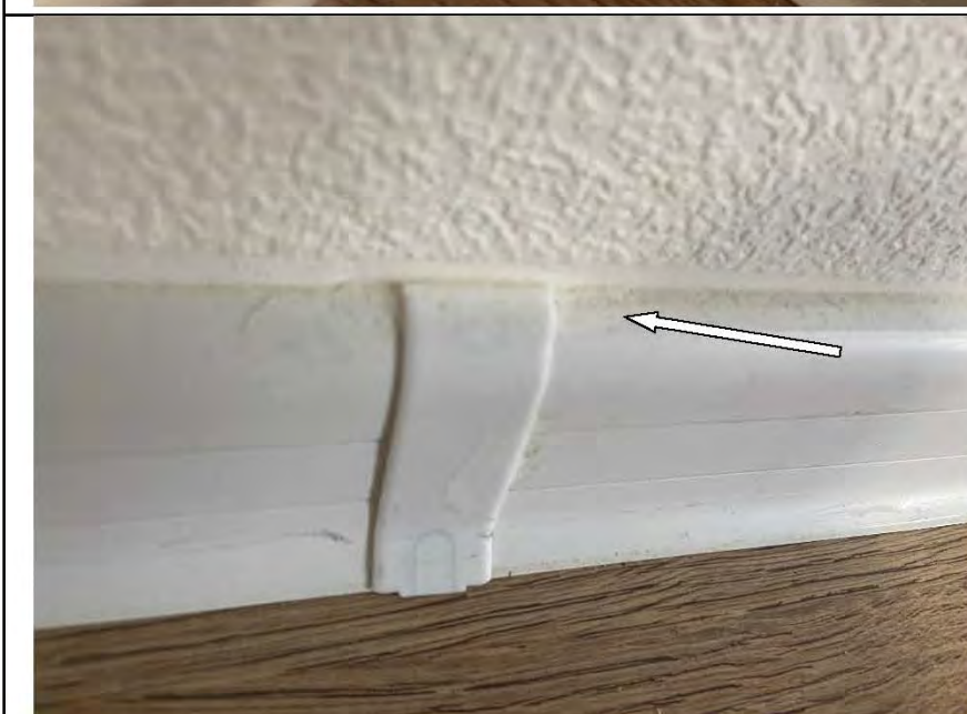
Фото №30. Дефекты на напольном плинтусе ПВХ в детской.
