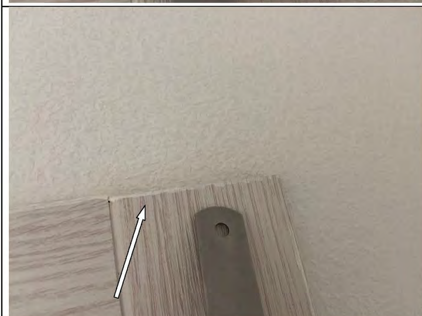
Фото №74. Загрязнения на наличниках деревянного дверного блока в спальне.
