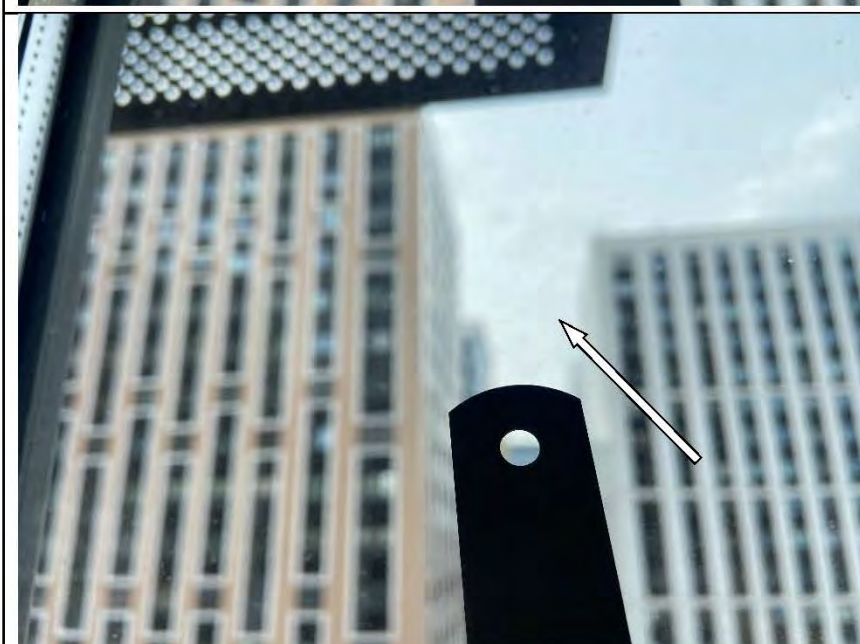
Фото №53. Царапина на стеклопакете оконного блока ПВХ в спальне.
