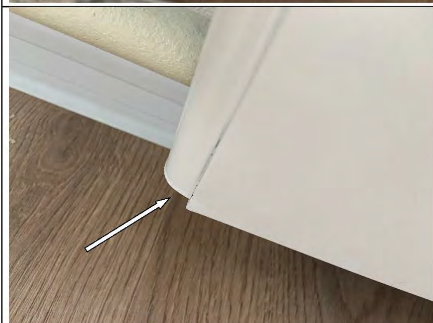
Фото №89. Дефекты на металлическом кожухе отопительного прибора в кухне.
