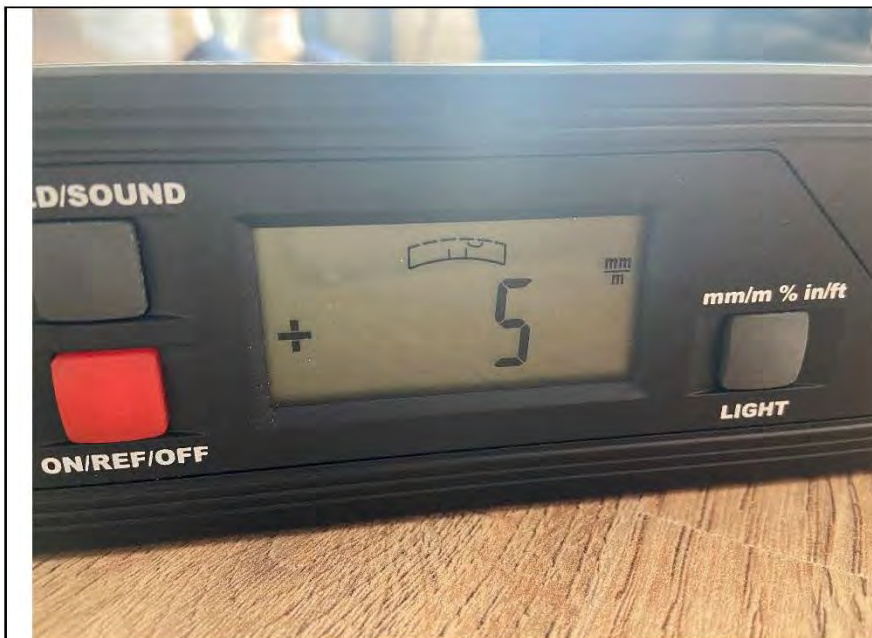
Фото №19. Отклонение напольного покрытия из ламината в кухне.
