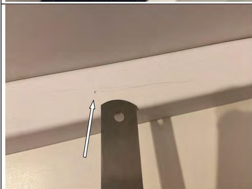
Фото №63. Царапина на коробке входного дверного блока в коридоре.
