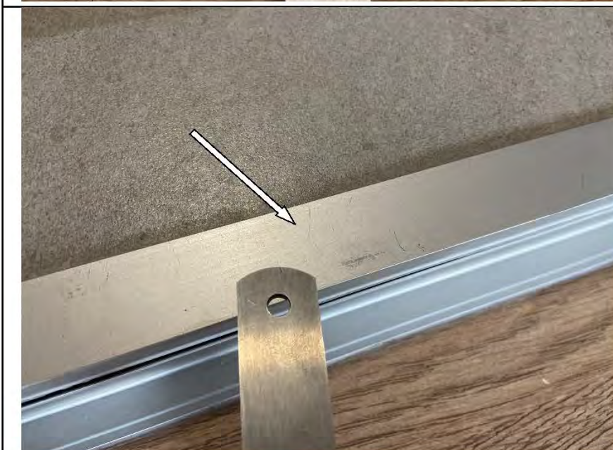
Фото №39. Дефект на напольном металлическом плинтусе в ванной комнате.
