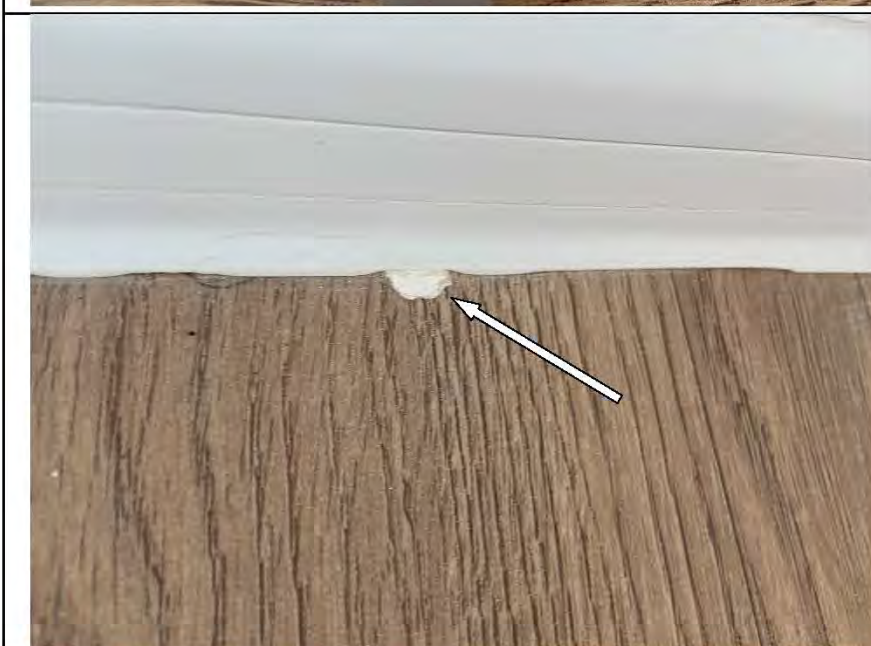
Фото №36. Дефект на напольном покрытии из ламината в спальне.
