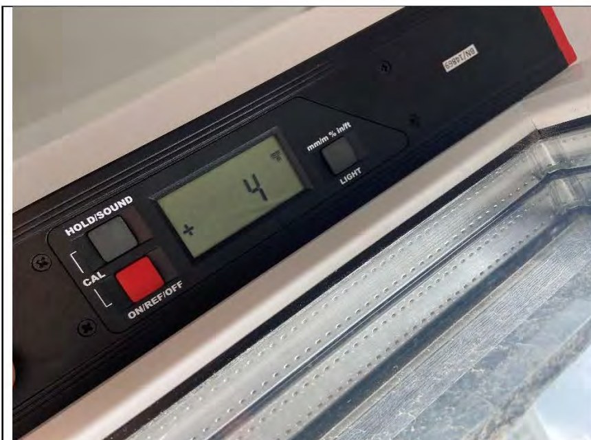
Фото №61. Отклонение оконного блока ПВХ по уровню вертикальности в спальне.
