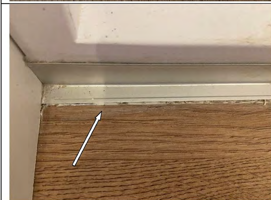
Фото №33. Загрязнения на напольном покрытии из ламината в коридоре.
