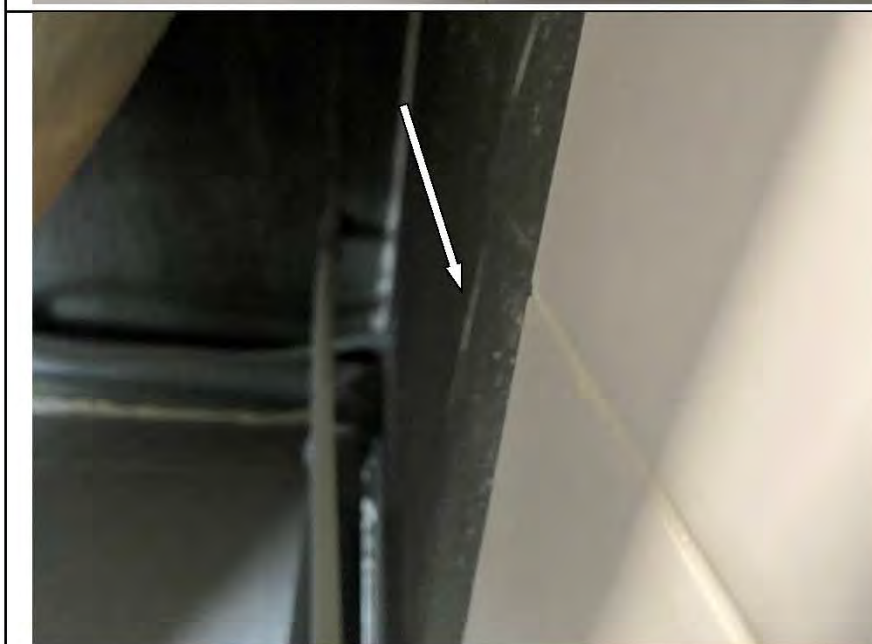
Фото №18. Частично отсутствует настенная керамическая плитка в ванной комнате.
