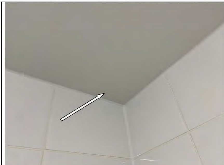
Фото №82. Загрязнения на подвесном потолке в санузле.
