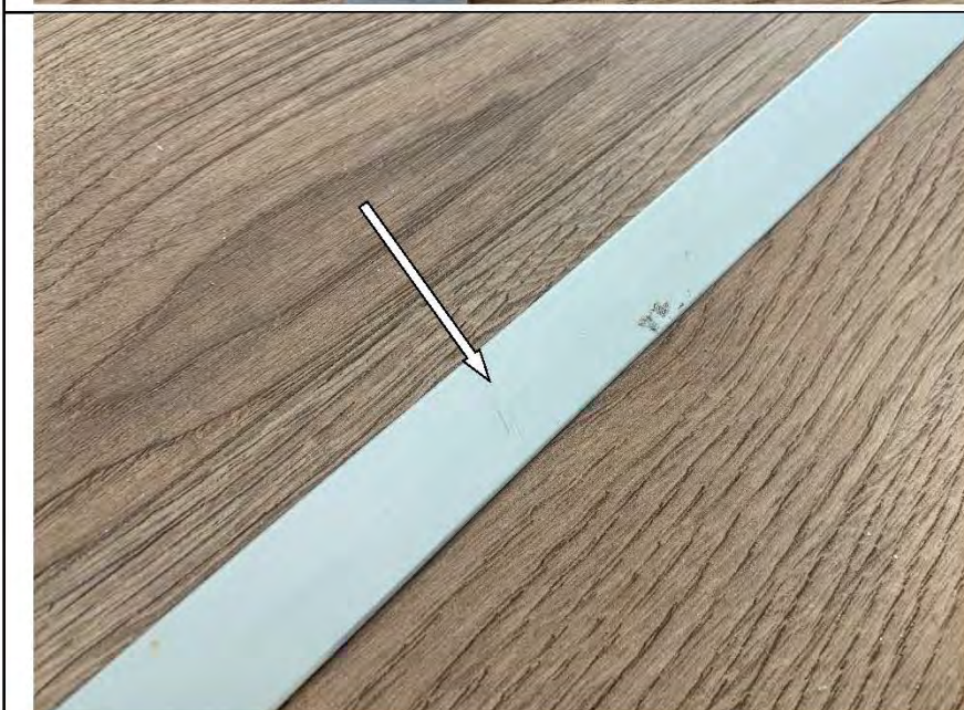
Фото №41. Дефект на напольном металлическом плинтусе в спальне.
