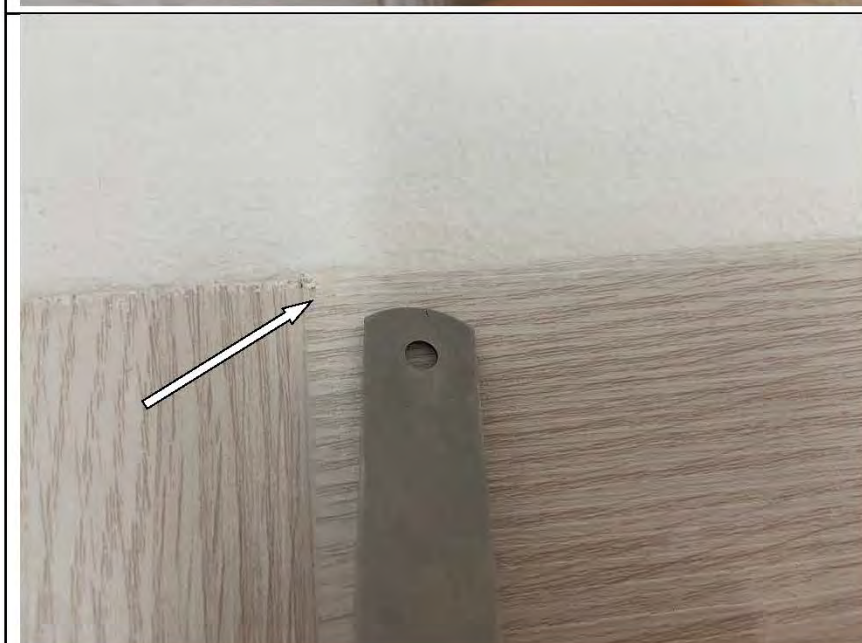
Фото №72. Загрязнения на наличниках деревянного дверного блока в ванной комнате.
