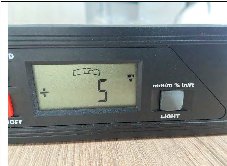
Фото №22. Отклонение напольного покрытия из ламината в спальне.
