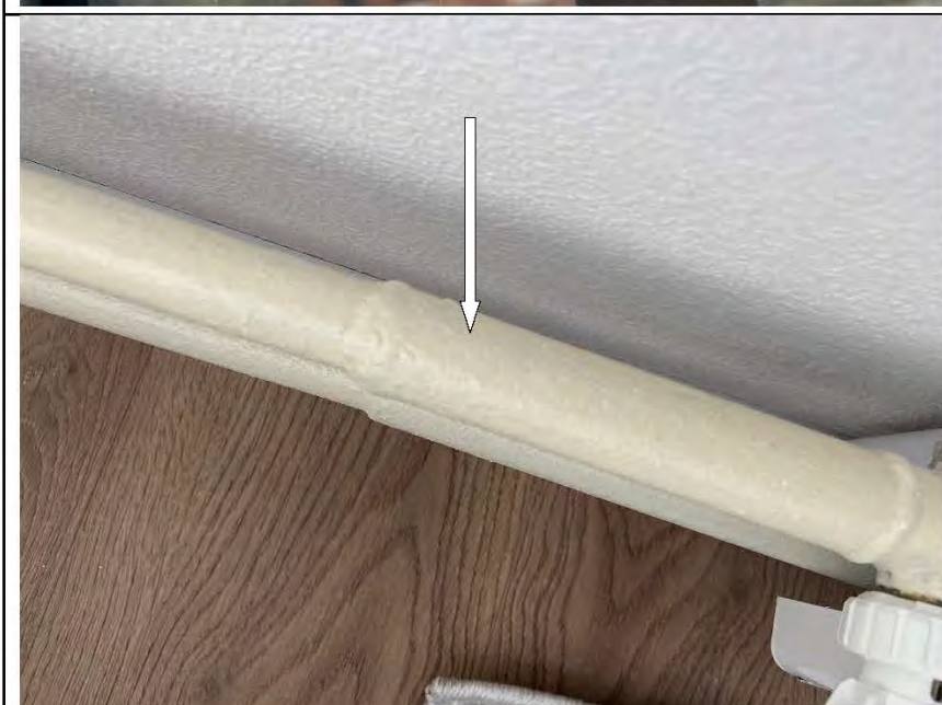
Фото №56. Неровности, подтеки на окрашенных трубах отопления в спальне.
