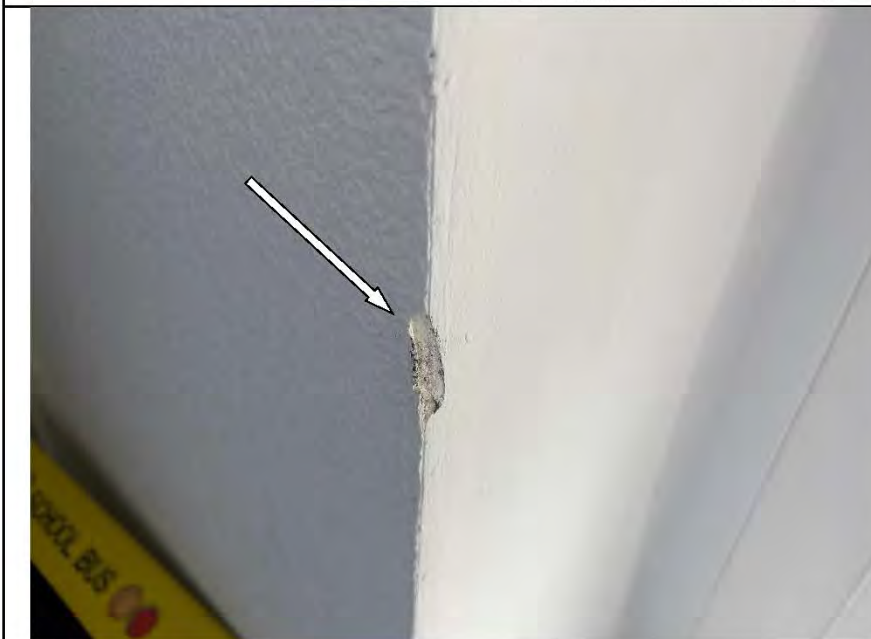
Фото №45. Неровности, выбоины, подтеки на окрашенных откосах оконного блока ПВХ в детской.
