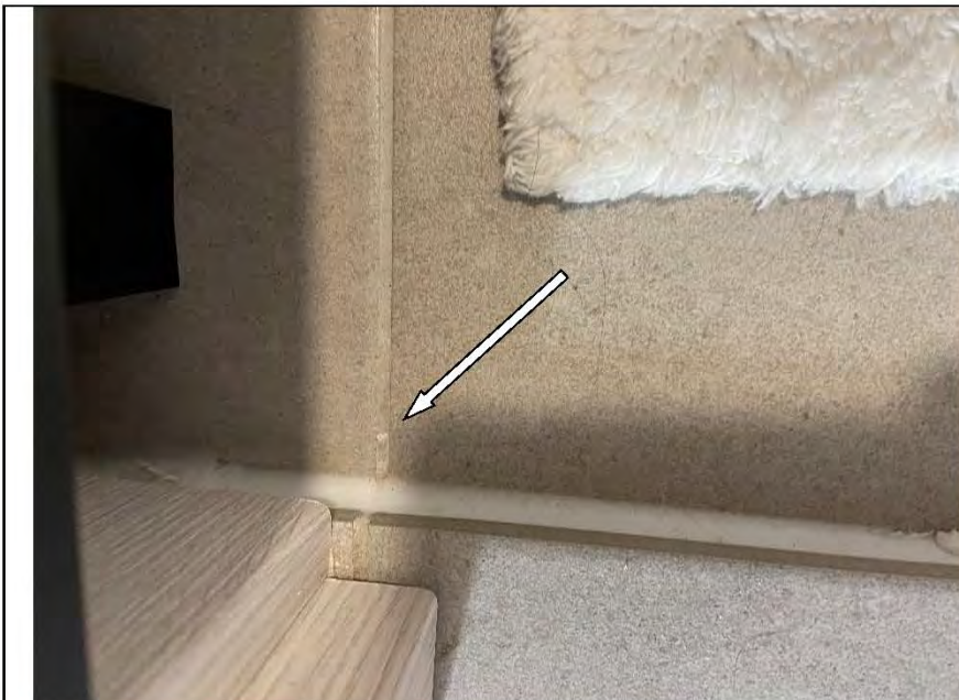
Фото №28. Неровные швы напольной керамической плитки в ванной комнате.
