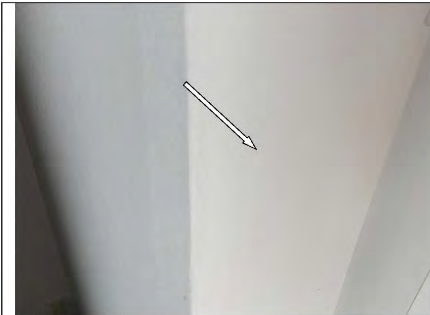
Фото №46. Неровности, выбоины, подтеки на окрашенных откосах оконного блока ПВХ в спальне.
