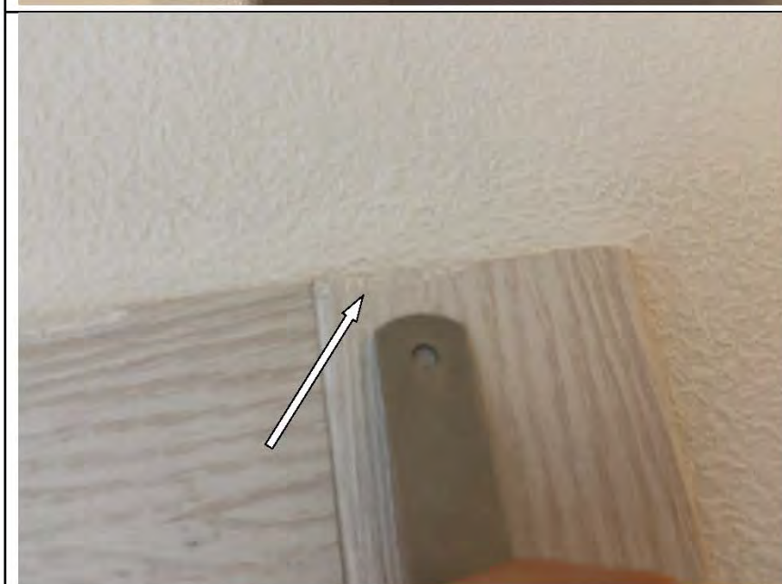
Фото №71. Загрязнения на наличниках деревянного дверного блока в санузле.
