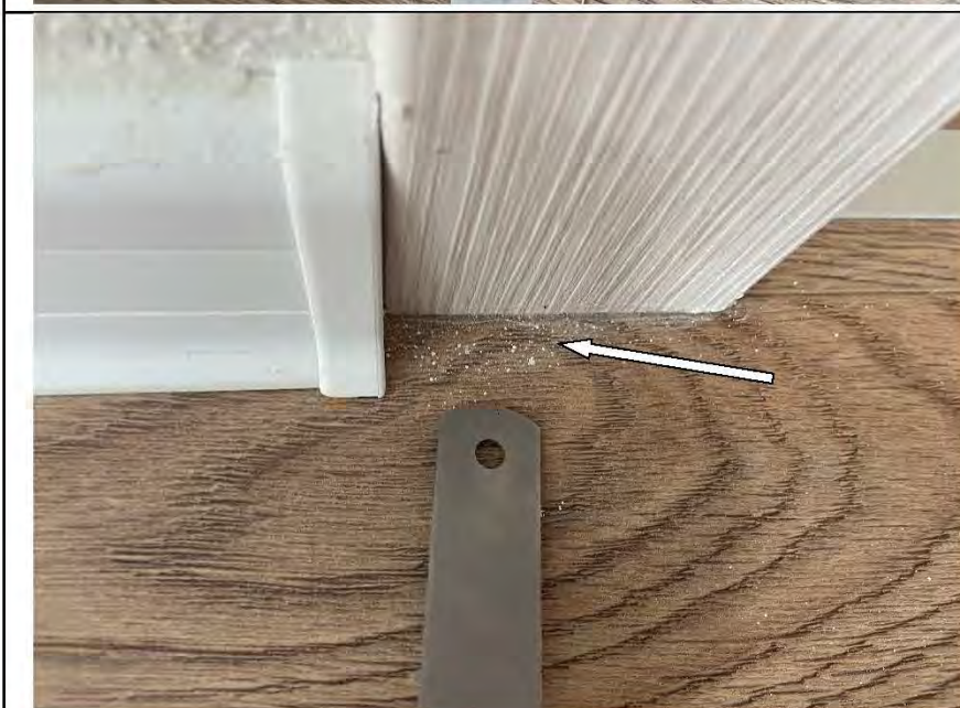
Фото №35. Загрязнения на напольном покрытии из ламината в спальне.
