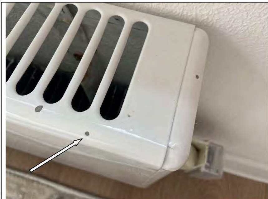
Фото №88. Дефекты на металлическом кожухе отопительного прибора в спальне.
