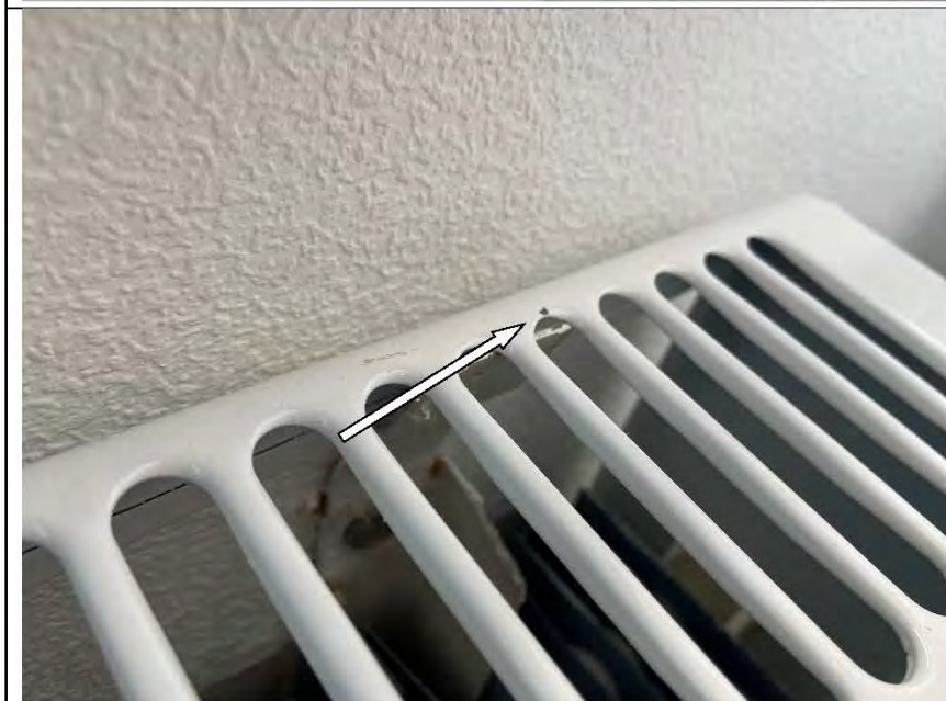
Фото №87. Дефекты на металлическом кожухе отопительного прибора в детской.
