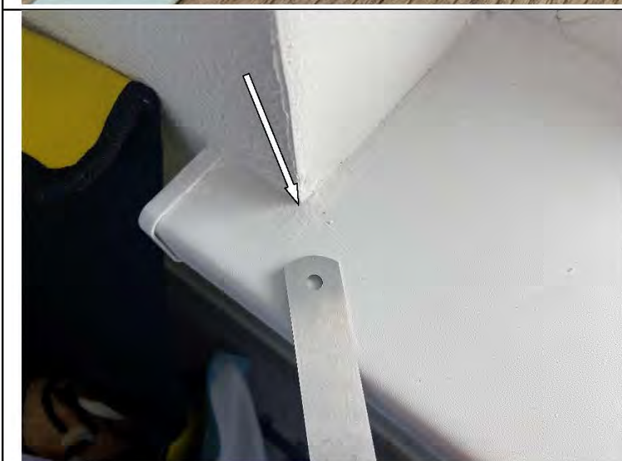
Фото №42. Загрязнения на лицевой стороне подоконной доски в детской.
