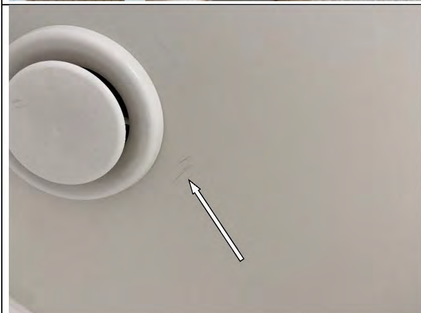
Фото №81. Загрязнения на подвесном потолке в ванной комнате.
