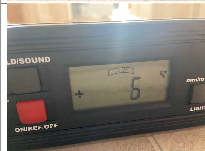
Фото №24. Отклонение напольного покрытия из керамической плитки в ванной комнате.
