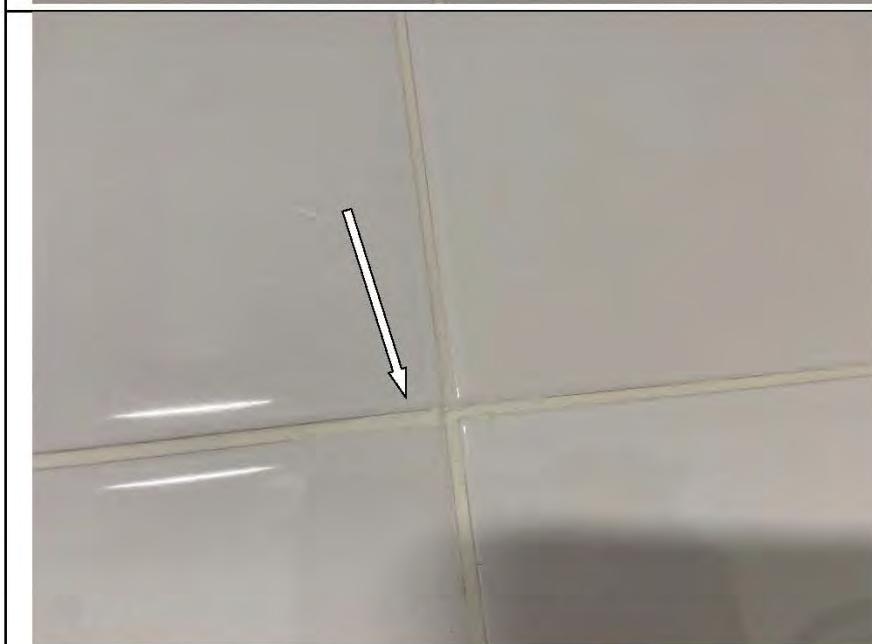
Фото №17. Неровные швы настенной керамической плитки в ванной комнате.
