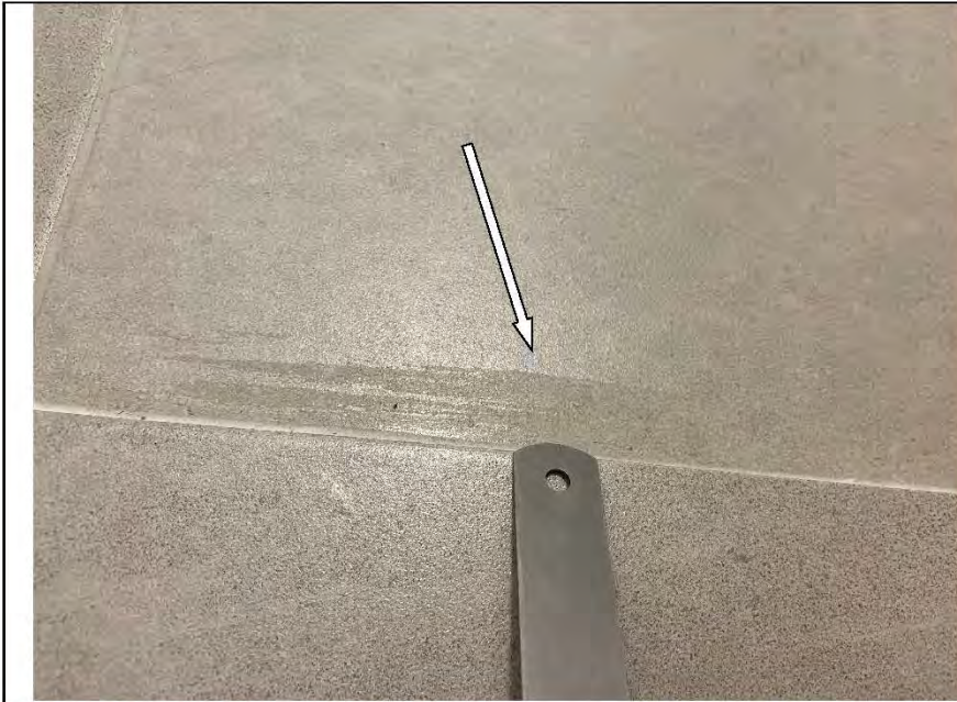
Фото №25. Загрязнения на напольной керамической плитке в санузле.
