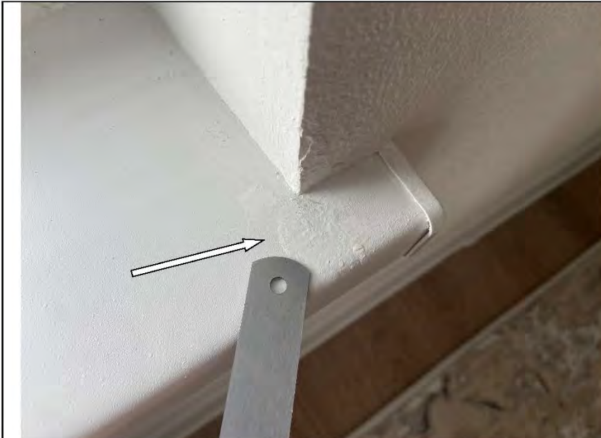
Фото №43. Загрязнения на лицевой стороне подоконной доски в спальне.
