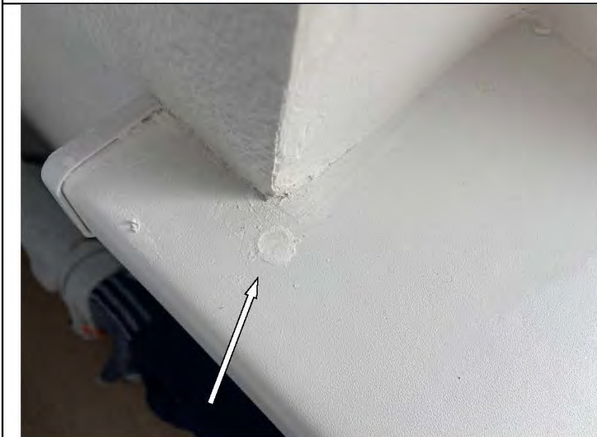
Фото №44. Загрязнения на лицевой стороне подоконной доски в детской.
