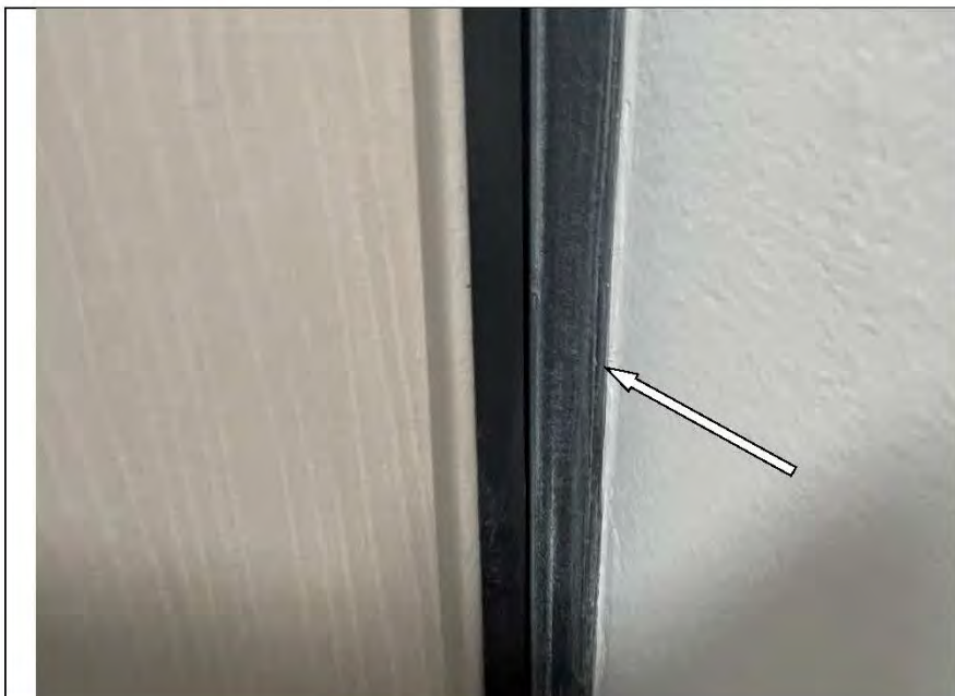
Фото №37. Царапина на коробке входного дверного блока.
