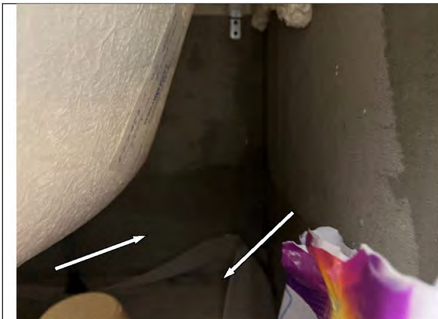
Фото №13. Частично отсутствует настенная и напольная керамическая плитка за ванной.
