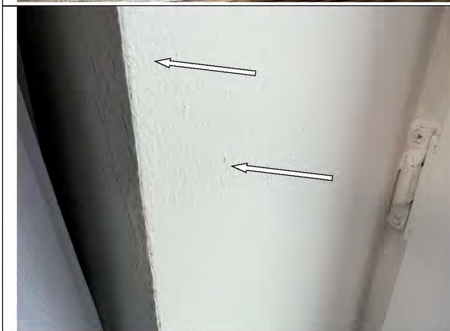
Фото №21. Подтеки краски на откосах оконного блока ПВХ в спальне.
