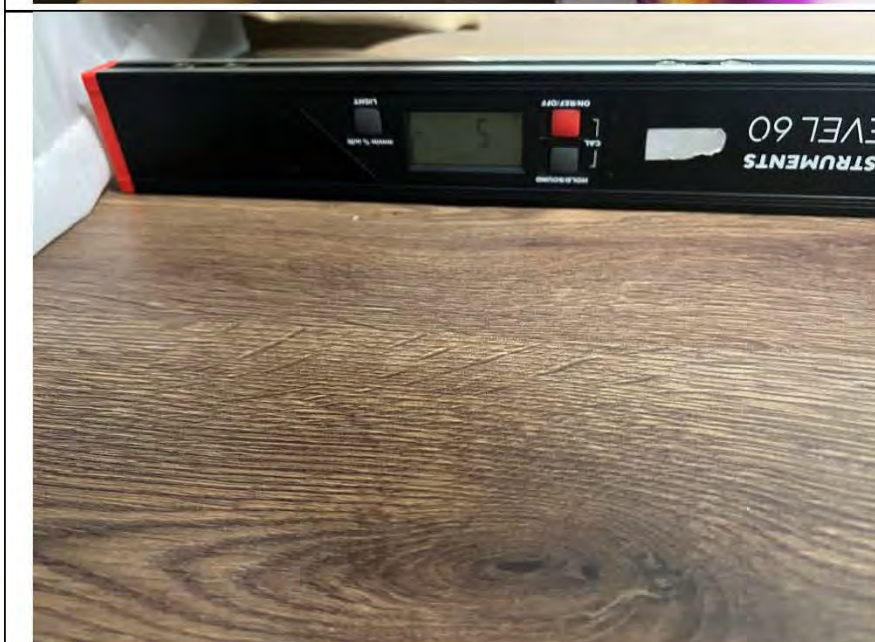
Фото №14. Измерение уровня напольного покрытия в спальне.
