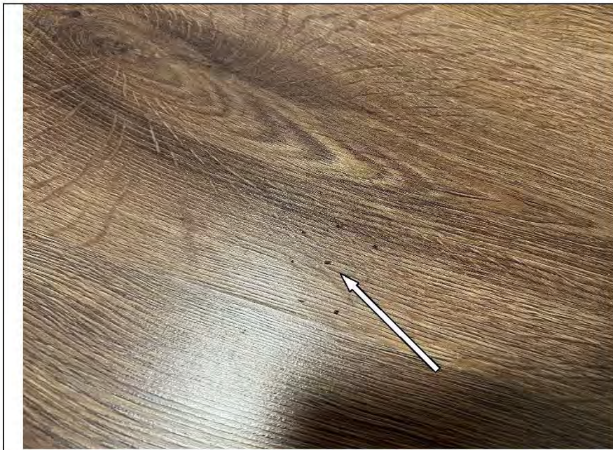
Фото №19. Механические повреждения ламината в коридоре.
