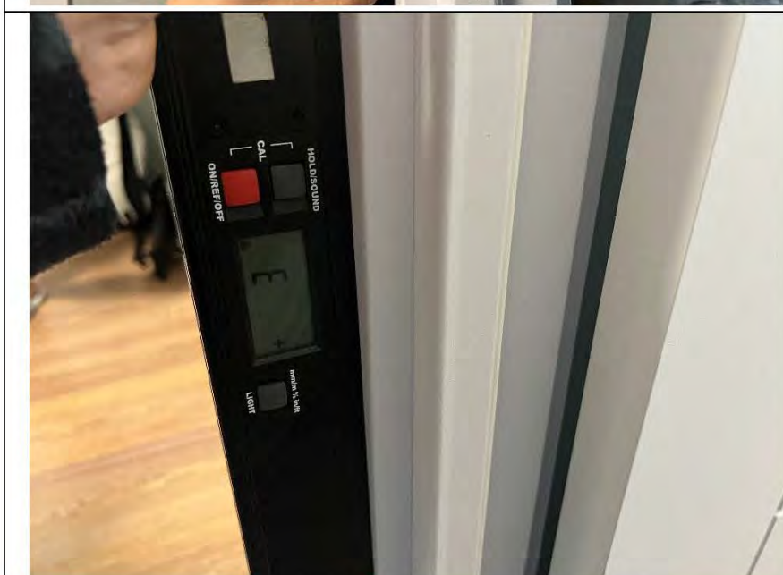
Фото №39. Отклонение наличников дверного блока в кухне по уровню вертикальности составляет 3 мм.
