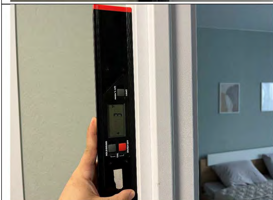
Фото №38. Отклонение наличников дверного блока в спальне по уровню вертикальности составляет 3 мм.
