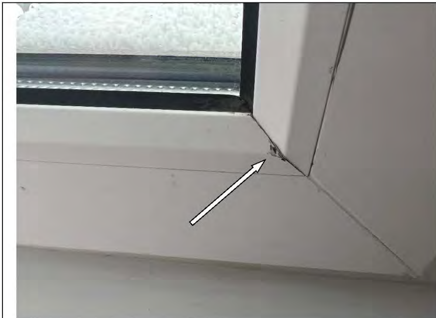
Фото №28. Зазоры в стыках профилей ПВХ оконного блока в кухне.
