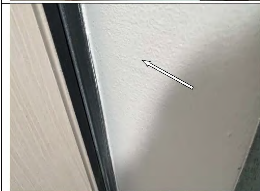
Фото №23. Подтеки краски на откосах входного дверного блока.
