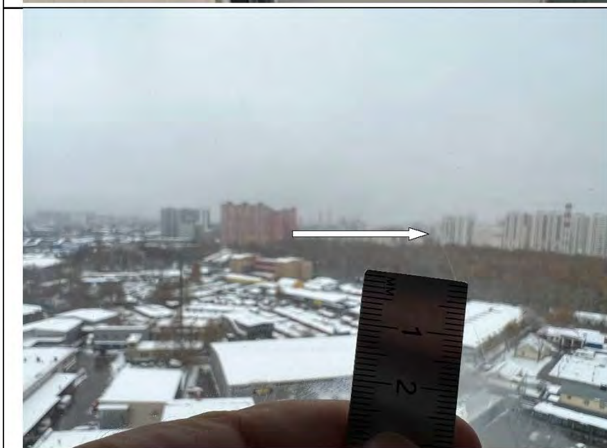
Фото №24. Царапина на стеклопакете оконного блока ПВХ в спальне.
