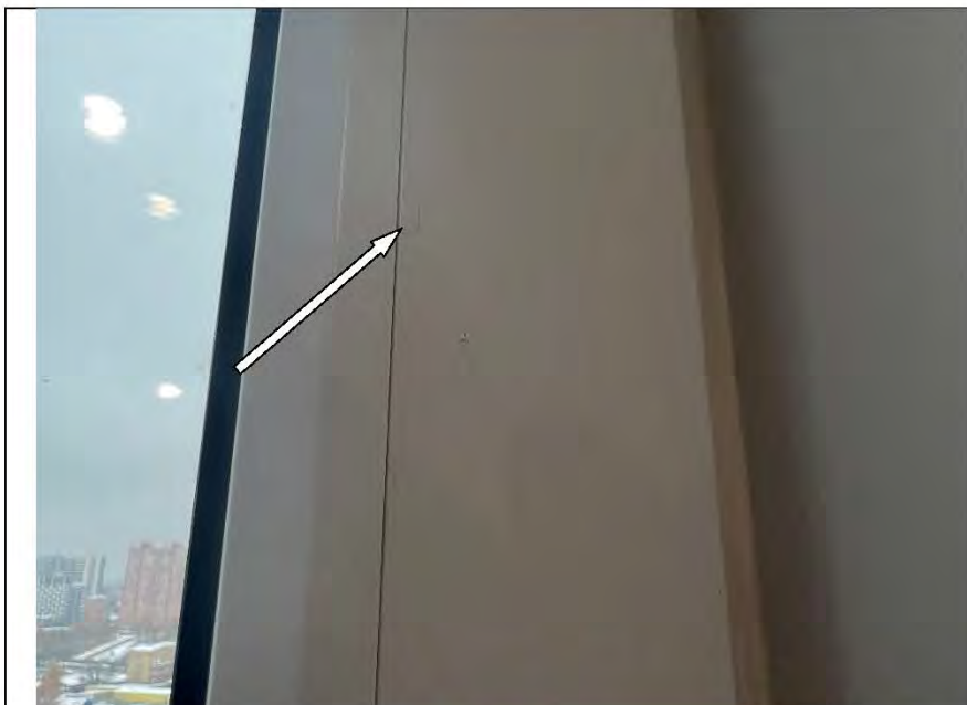
Фото №31. Царапина на профиле ПВХ оконного блока в кухне.
