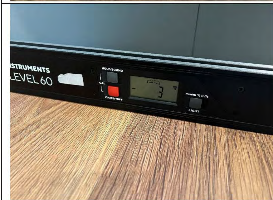
Фото №15. Измерение уровня напольного покрытия в кухне.
