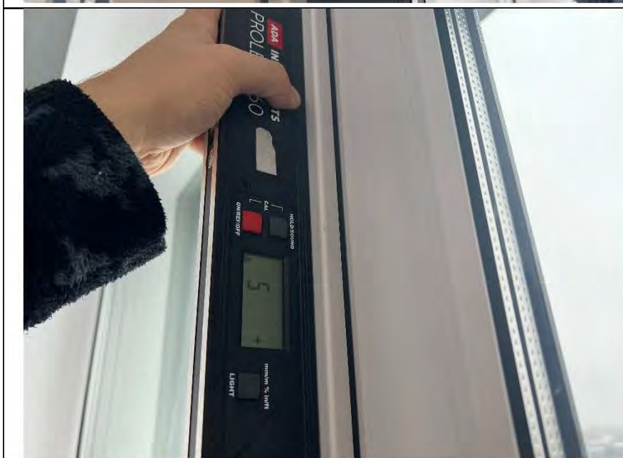
Фото №33. Отклонение оконного блока ПВХ в кухне по уровню вертикальности составляет 5 мм.
