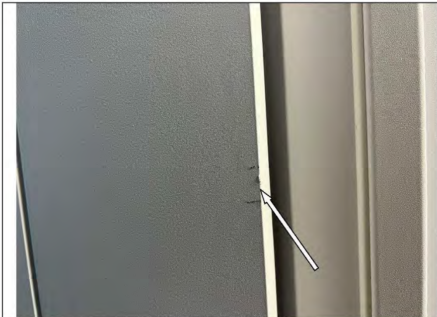
Фото №40. Скол на лицевой поверхности полотна дверного блока в спальне.
