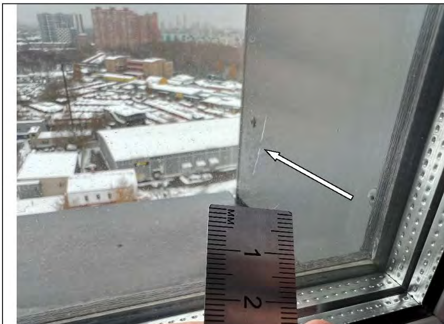
Фото №25. Царапина на стеклопакете оконного блока ПВХ в спальне.
