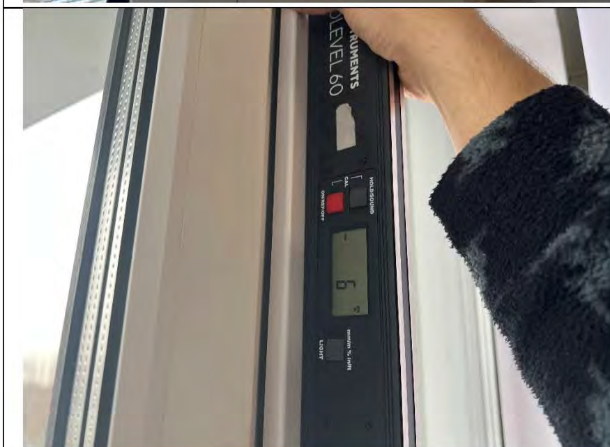
Фото №32. Отклонение оконного блока ПВХ в спальне по уровню вертикальности составляет 6 мм.
