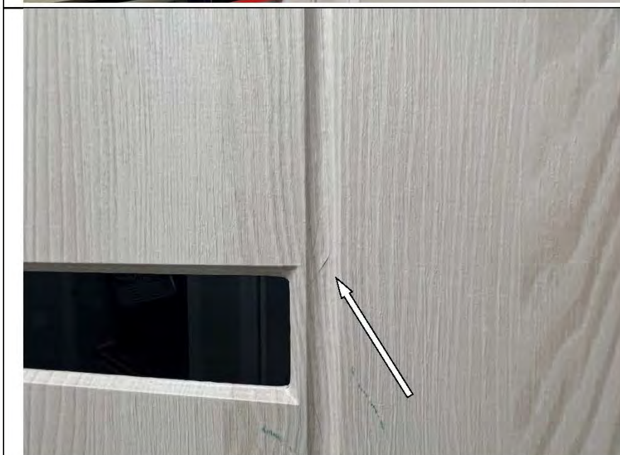
Фото №44. Царапина на полотне входного дверного блока.
