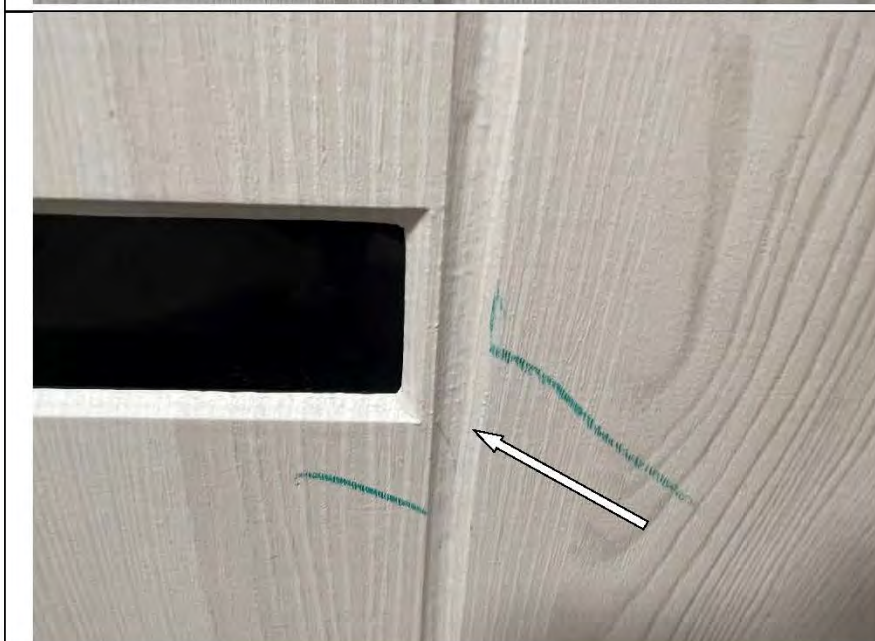
Фото №45. Царапина на полотне входного дверного блока.
