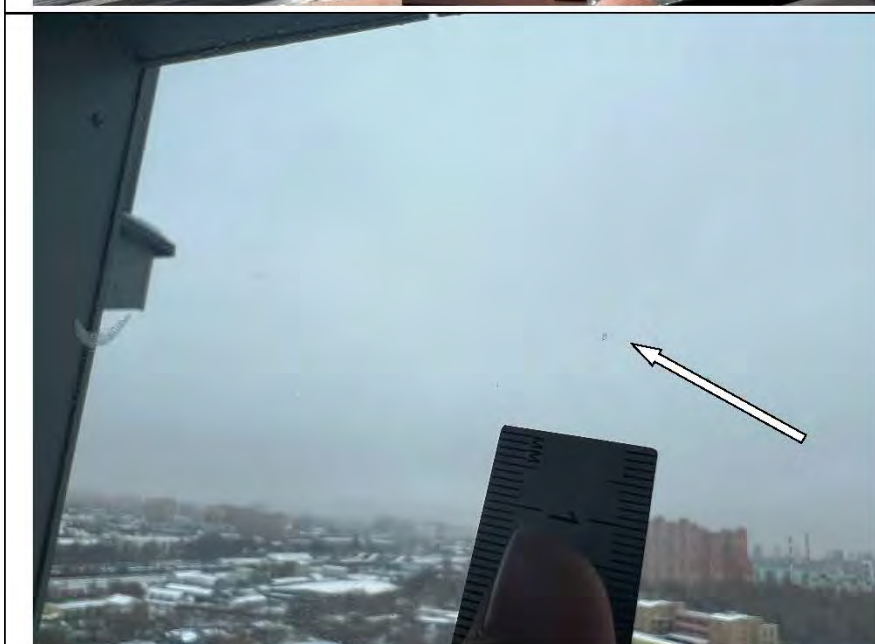
Фото №26. Окалина на внутренней стороне стеклопакете оконного блока ПВХ в кухне.
