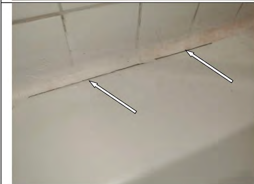
Фото №60. Некачественно выполнена герметизация стыка душевого поддона со стеной.
