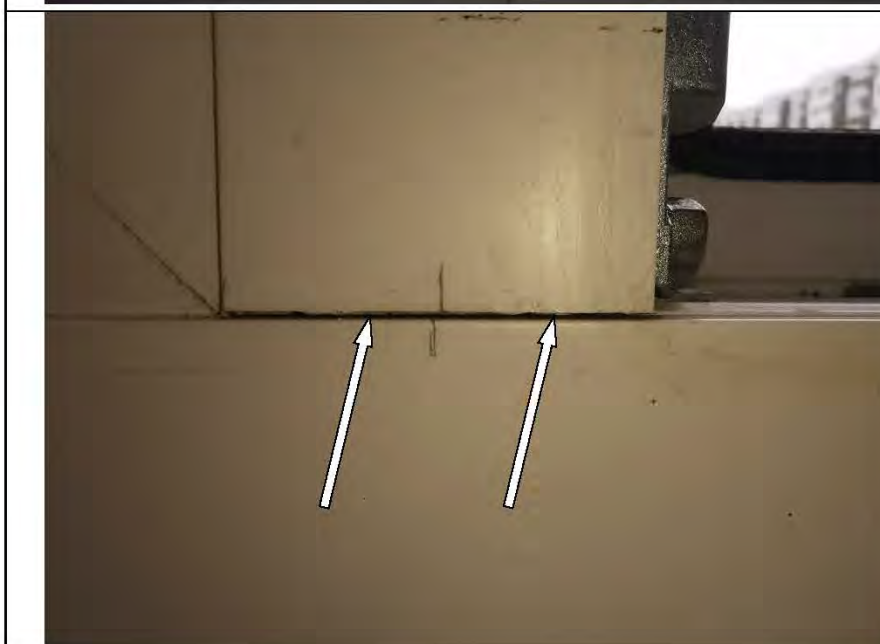
Фото №39. Зазор в месте стыка профилей ПВХ оконного блока в комнате.
