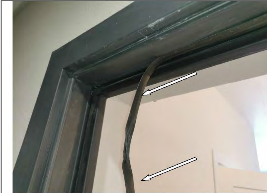
Фото №55. Скол на коробе входного дверного блока.
