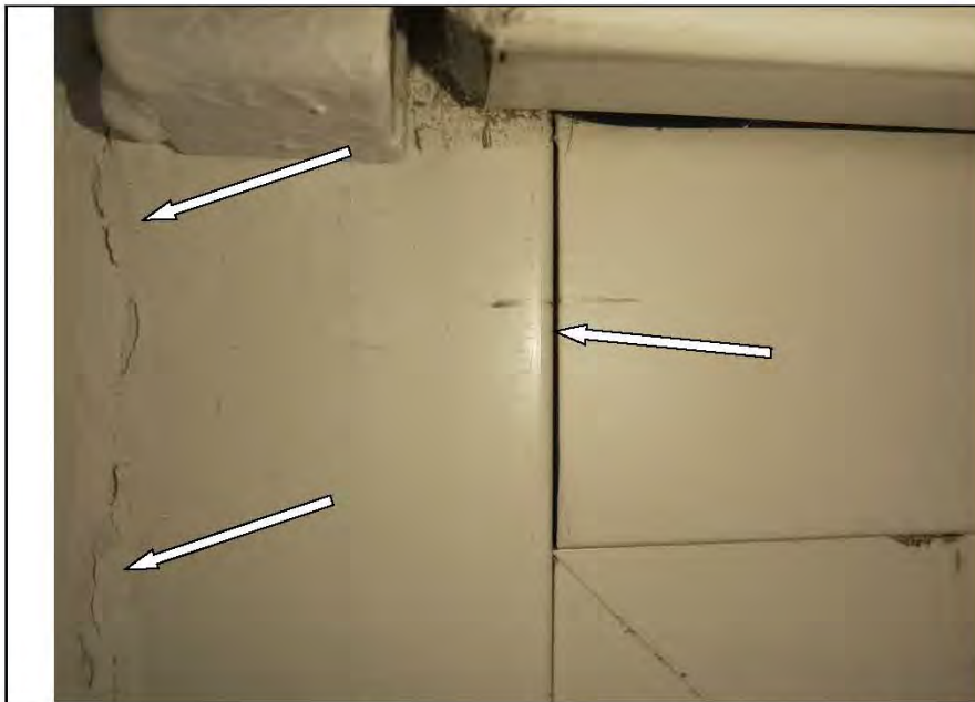
Фото №37. Загрязнение профилей ПВХ оконного блока, зазор в месте стыка профилей ПВХ оконного блока в комнате.
