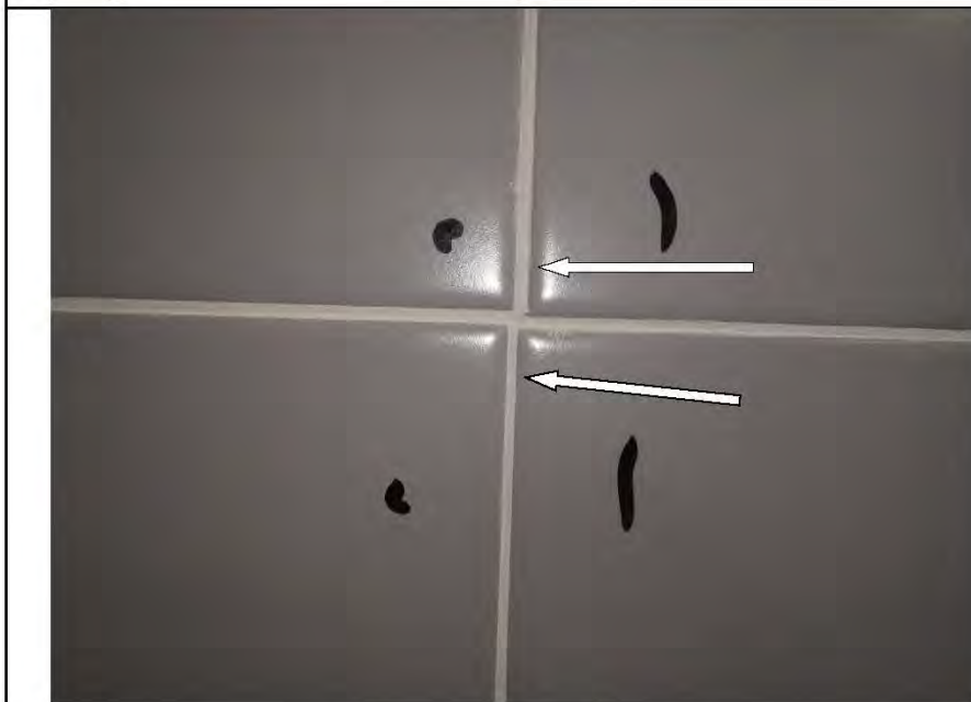
Фото №14. Затирка настенной плитки в санузле выполнена с нарушениями.
