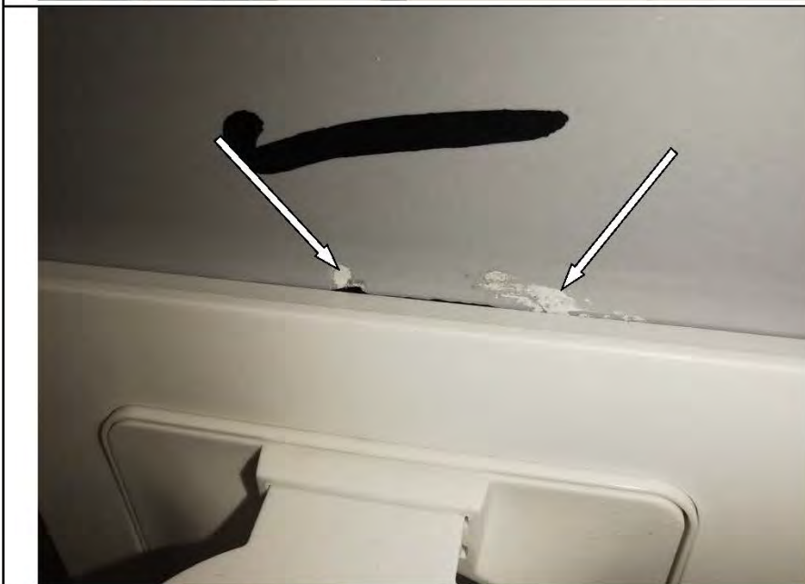
Фото №56. Отбитости настенной керамической плитки в санузле.
