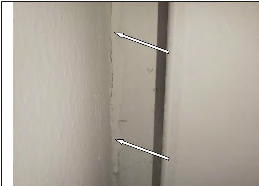
Фото №43. Окрашенные откосы оконного блока ПВХ выполнены с дефектами в комнате.
