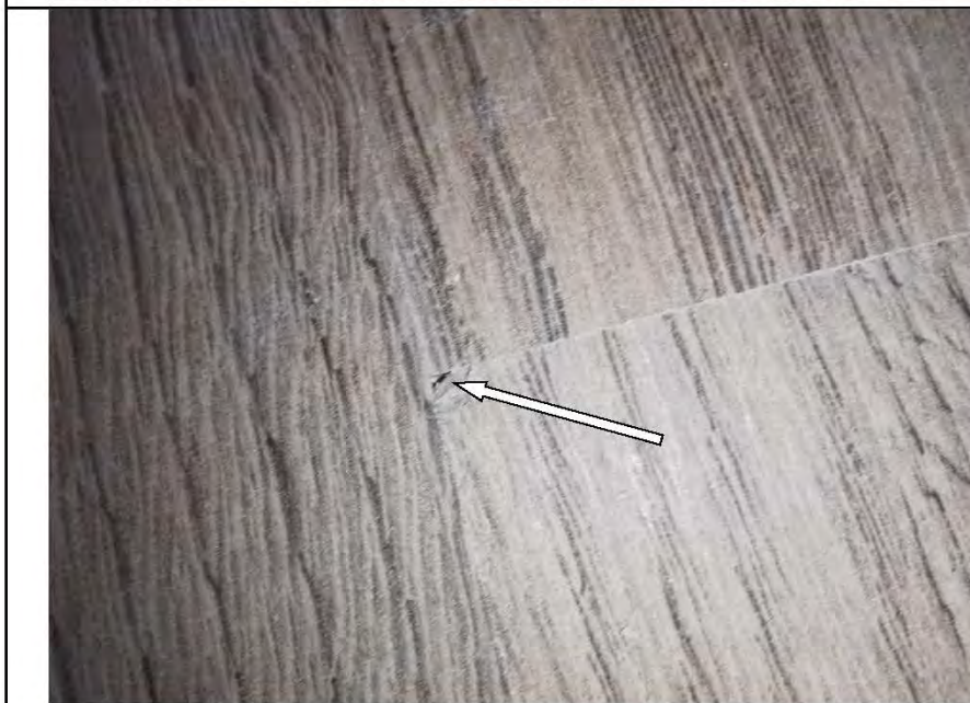
Фото №20. Повреждение ламината в комнате (скол).
