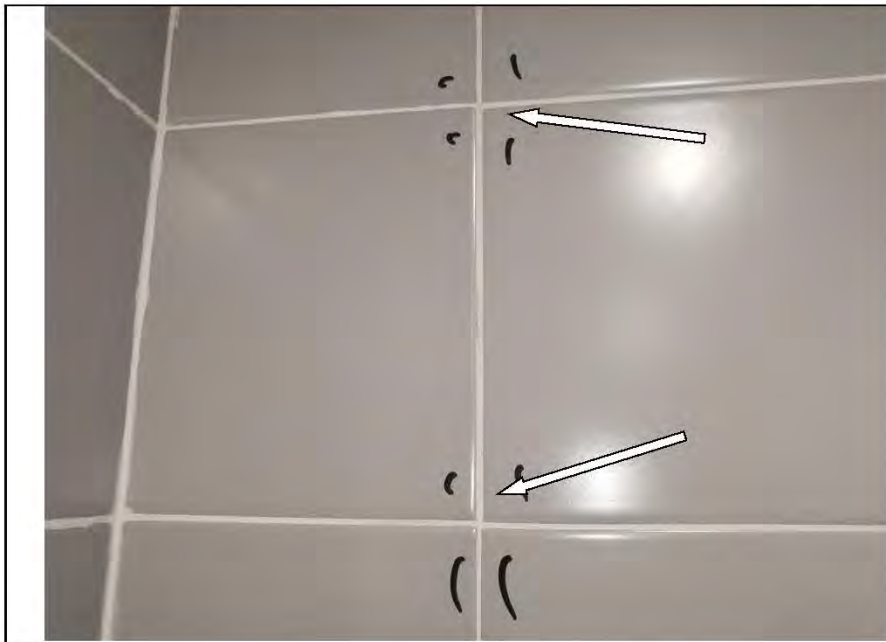
Фото №13. Затирка настенной плитки в санузле выполнена с нарушениями.
