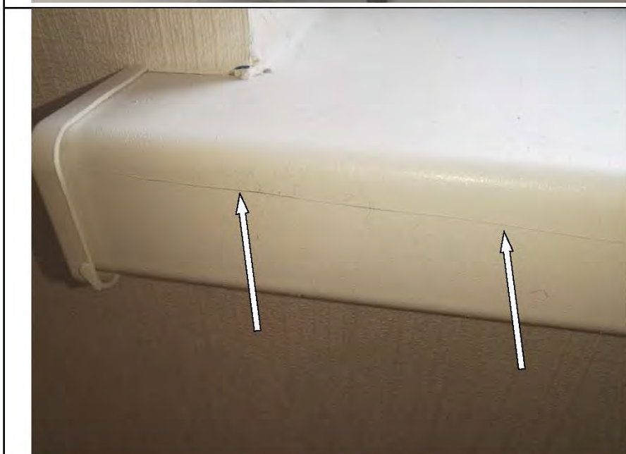
Фото №44. Царапины на лицевой поверхности подоконной доски в комнате.
