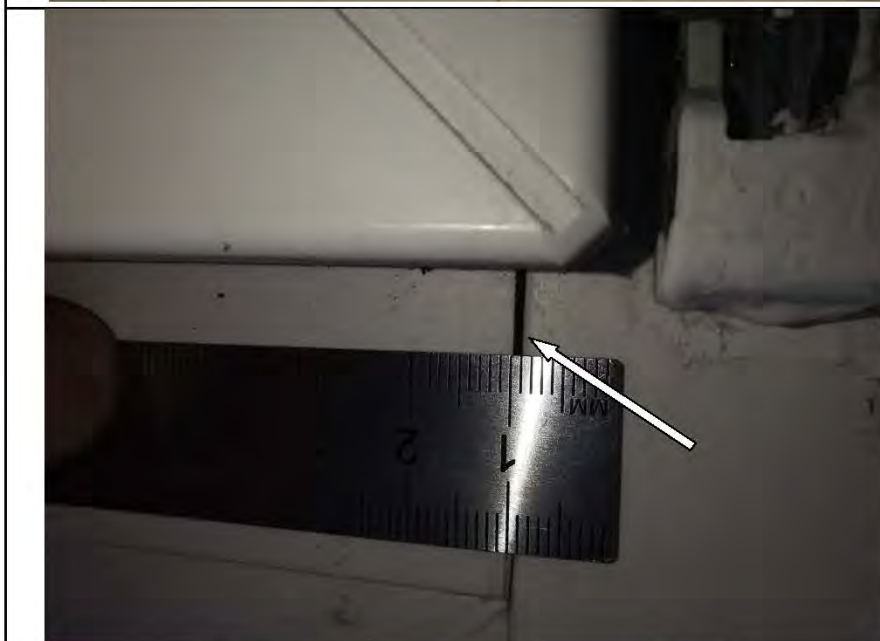
Фото №38. Зазор в месте стыка профилей ПВХ оконного блока в комнате.
