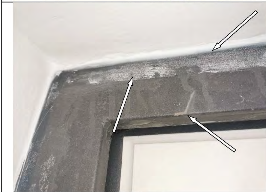
Фото №50. Загрязнение короба входного дверного блока, следы коррозии.
