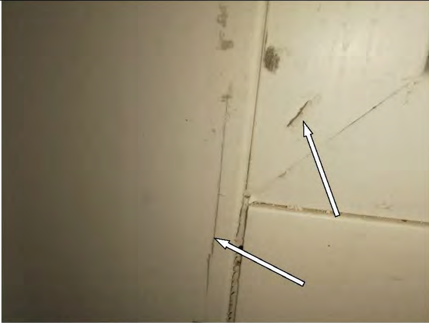
Фото №34. Царапины и загрязнения на профиле ПВХ оконного блока в комнате.
