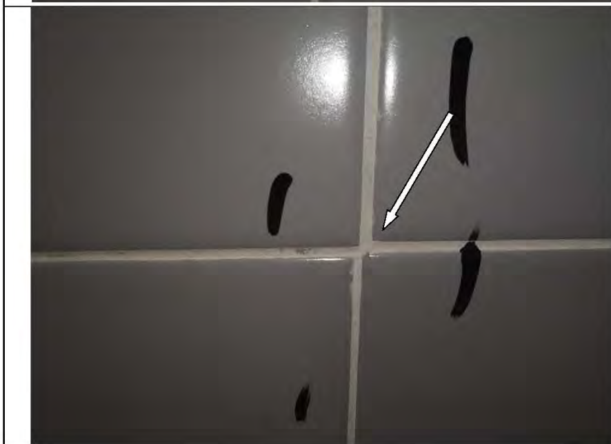
Фото №15. Затирка настенной плитки в санузле выполнена с нарушениями.
