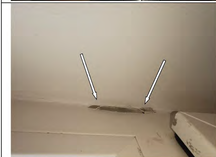
Фото №41. Окрашенные откосы оконного блока ПВХ выполнены с дефектами в комнате.
