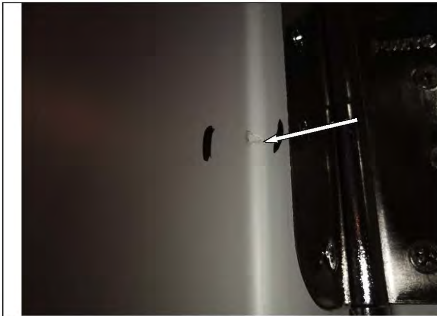
Фото №46. Скол на полотне деревянного дверного блока в санузле.
