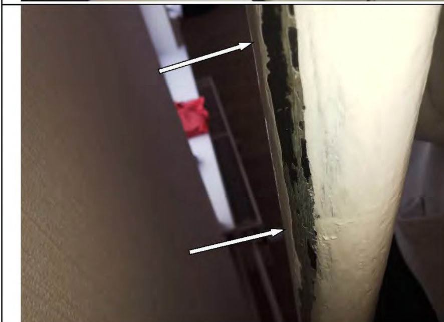
Фото №57. Окрашивание труб отопления выполнено с дефектами в комнате.
