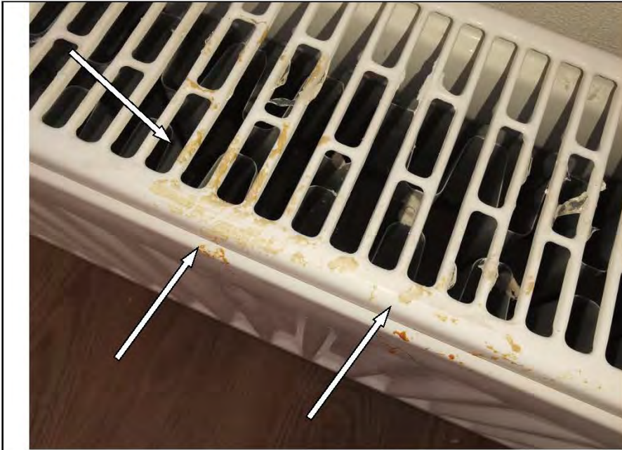
Фото №58. Загрязнение радиатора в комнате.
