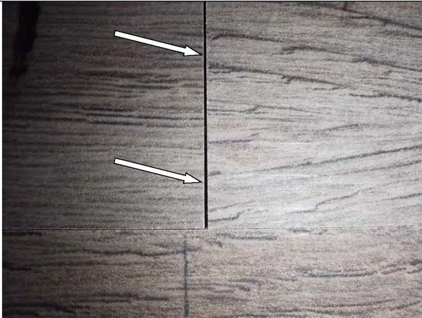
Фото №22. Зазор между соседними досками ламината в коридоре.
