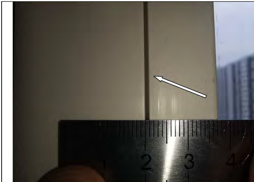
Фото №40. Зазор в месте стыка профилей ПВХ оконного блока в комнате.
