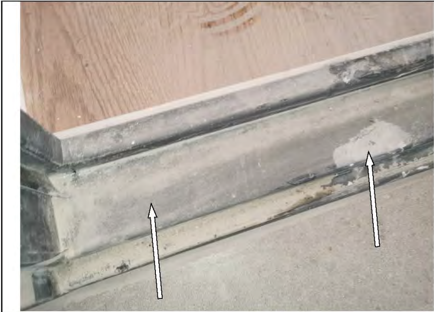
Фото №52. Загрязнение короба входного дверного блока.
