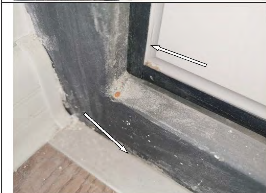
Фото №51. Загрязнение короба входного дверного блока, следы коррозии.
