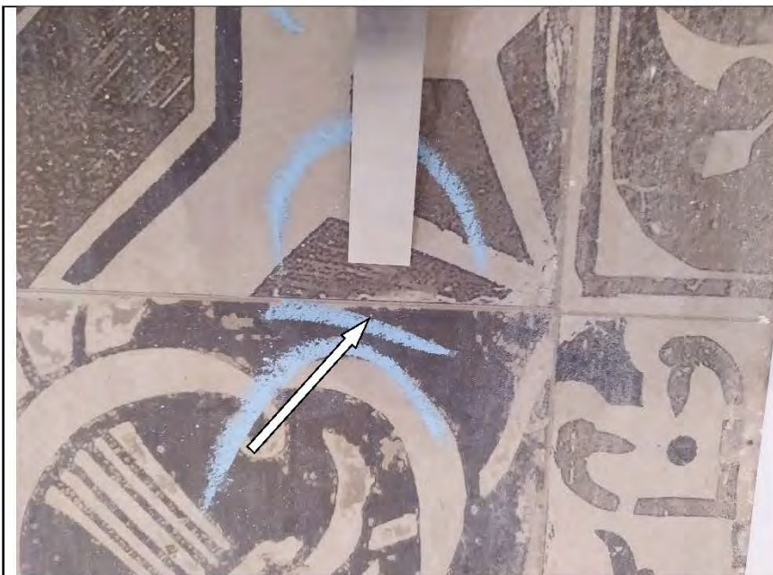
Фото №85. Сколы, отбитости напольной керамической плитки в кухне
