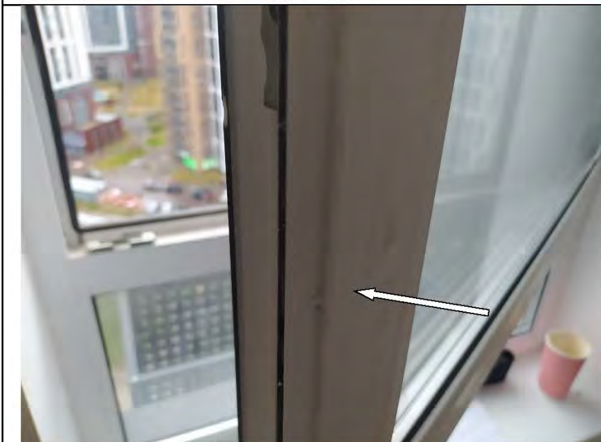
Фото №35. Профиль ПВХ оконного блока №3 в спальне имеет дефекты (загрязнение малярными составами).
