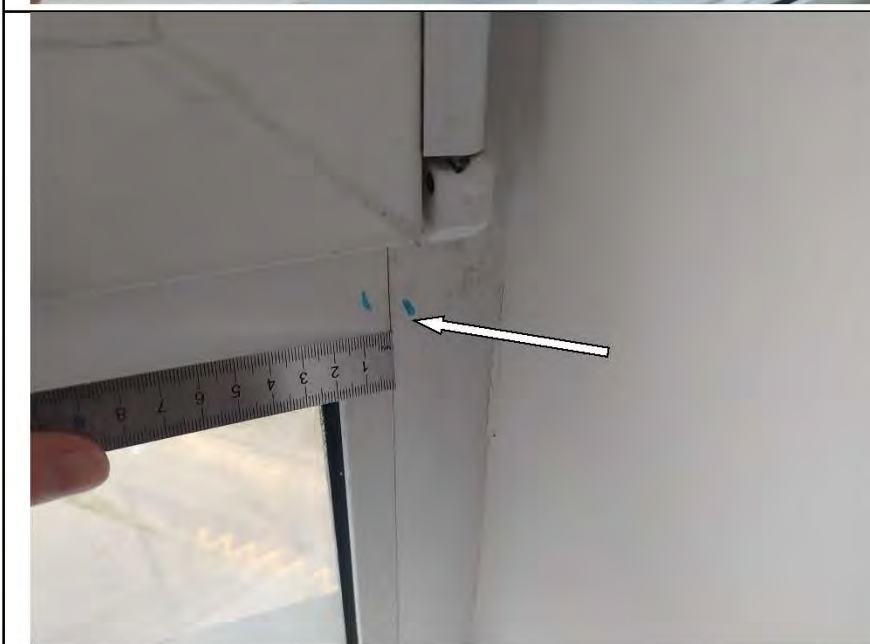
Фото №33. Профиль ПВХ оконного блока №2 в спальне имеет дефекты (зазор).
