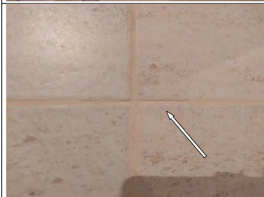
Фото №66. Затирка настенной плитки в ванной комнате выполнена с нарушениями (каверны)
