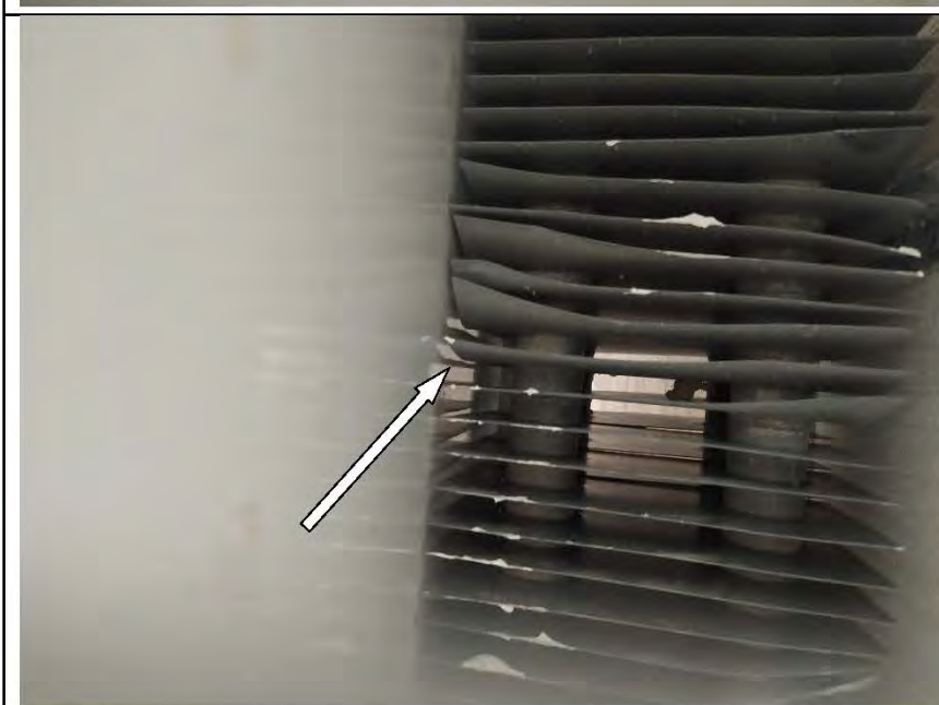
Фото №81. Радиатор №1 в спальне имеет дефекты (замятия).
