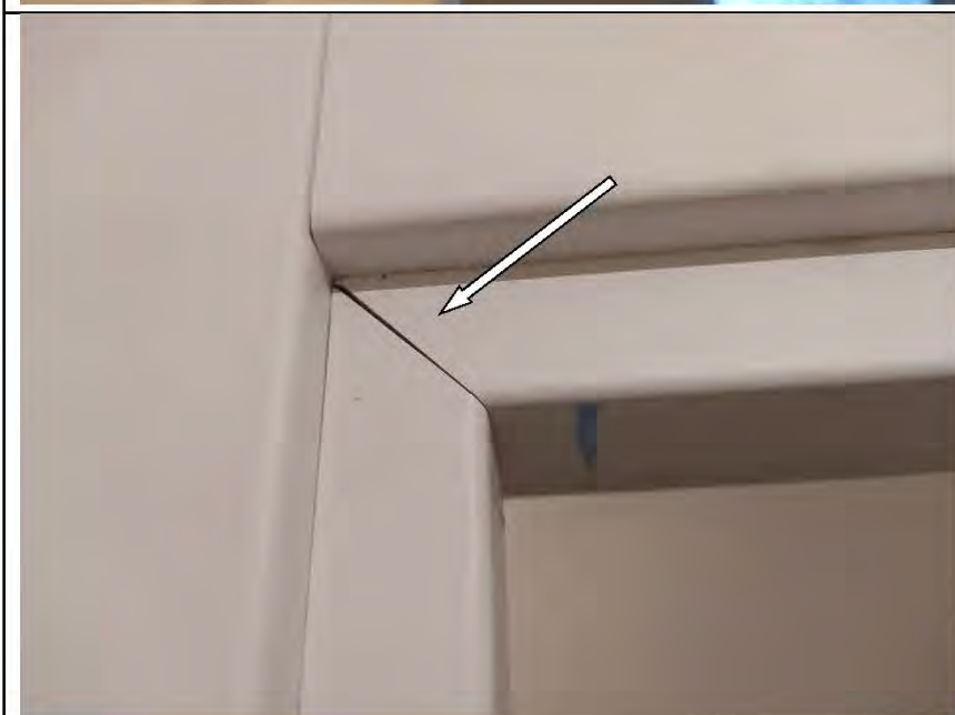
Фото №54. Элементы дверного блока соединены (коробка) не надежно в санузле
