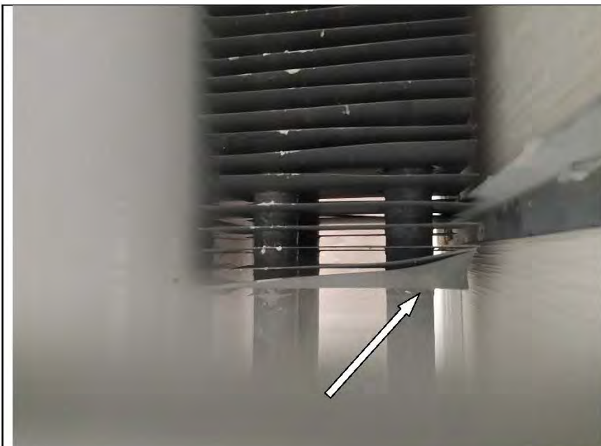
Фото №82. Радиатор №2 в спальне имеет дефекты (замятия).
