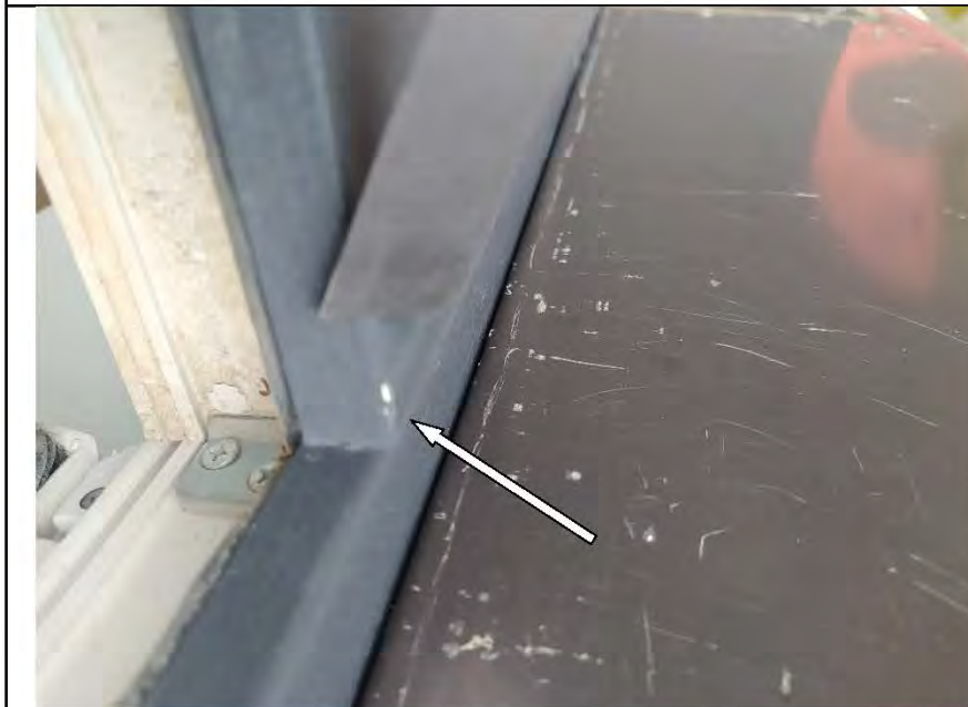
Фото №29. Профиль ПВХ оконного блока №1 в спальне имеет дефекты (скол).
