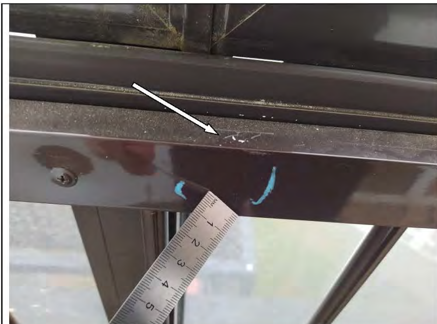
Фото №73. Дефект металлического профиля ограждения балкона (сколы).
