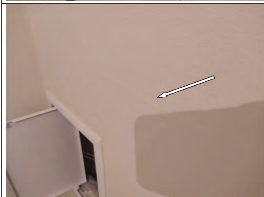
Фото №65. Окрашенные стены в ванной комнате выполнены с дефектами (трещины)
