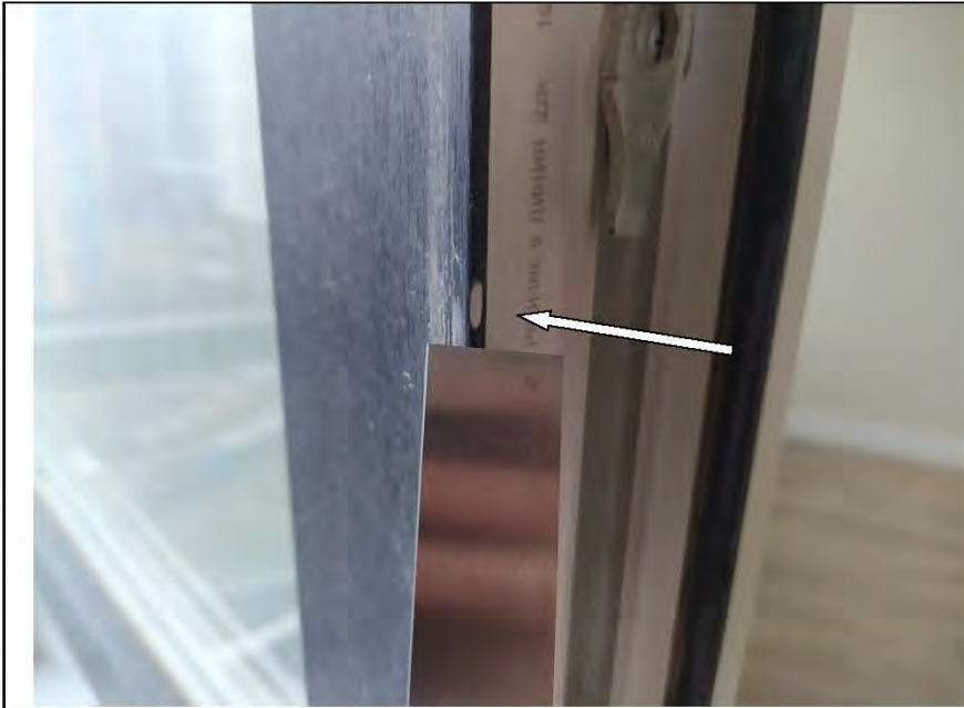
Фото №31. Профиль ПВХ оконного блока №2 в спальне имеет дефекты (скол).
