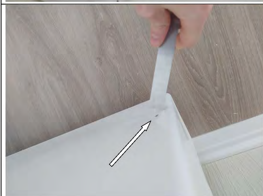
Фото №78. Отопительный прибор имеет дефект покраски защитного кожуха №3 в спальне (скол)
