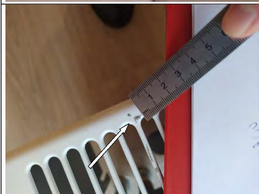
Фото №75. Отопительный прибор имеет дефект покраски защитного кожуха в кухне (скол)
