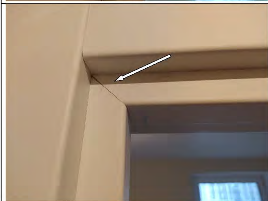
Фото №53. Элементы дверного блока соединены (коробка) не надежно в гостиной
