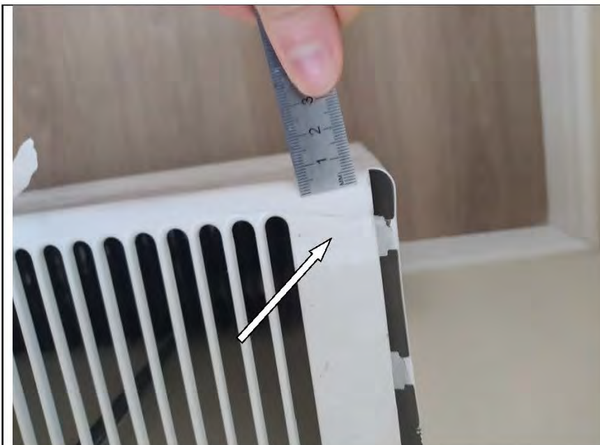
Фото №79. Отопительный прибор имеет дефект покраски защитного кожуха №4 в гостиной (царапина)
