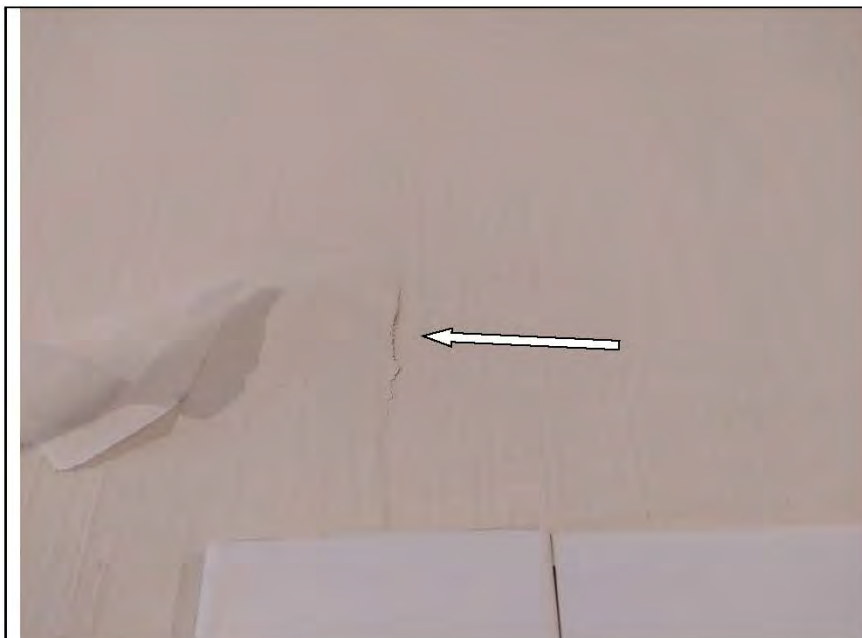
Фото №61. Отслоение обоев в кухне
