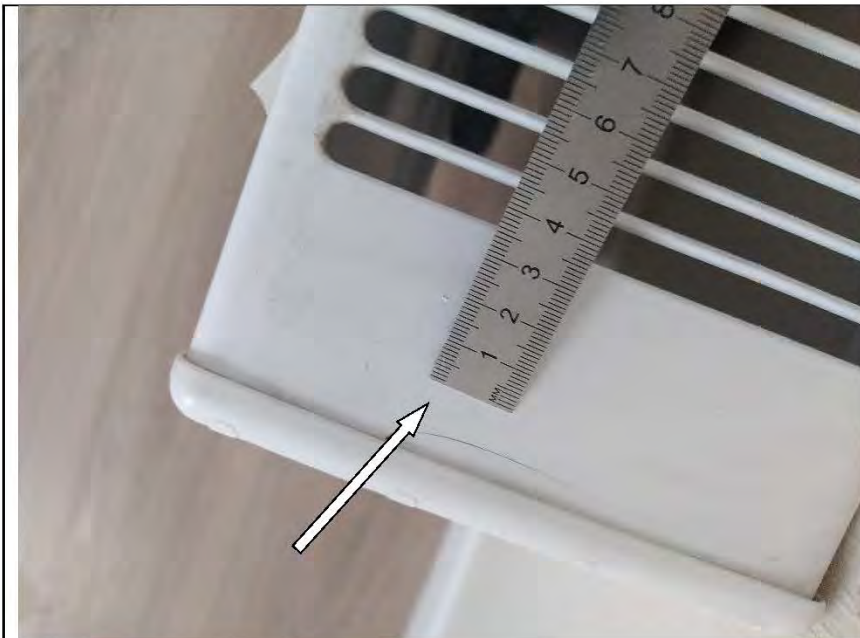
Фото №76. Отопительный прибор имеет дефект покраски защитного кожуха №1 в спальне (царапина)
