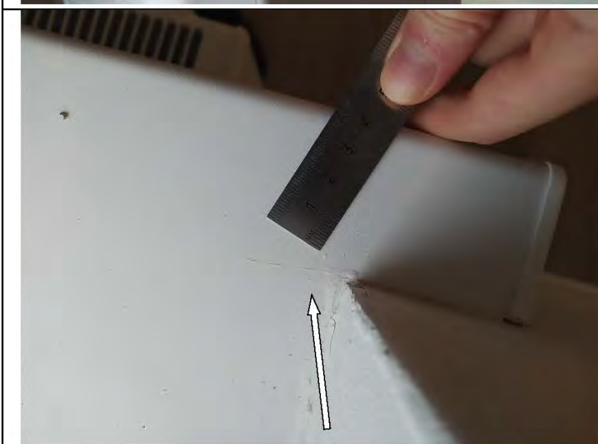
Фото №42. На лицевой поверхности подоконной доски №5 в гостиной имеются дефекты (царапины).
