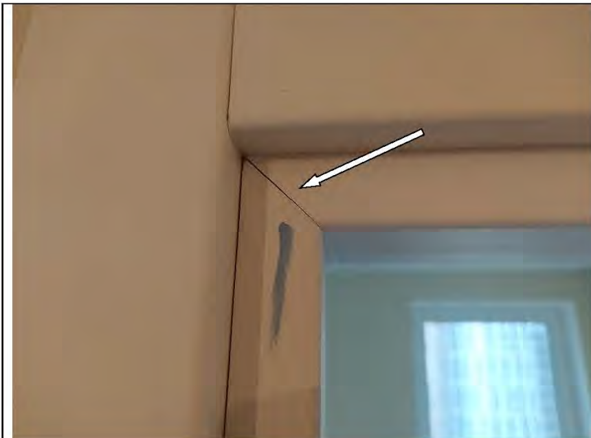
Фото №52. Элементы дверного блока соединены (коробка) не надежно в спальне
