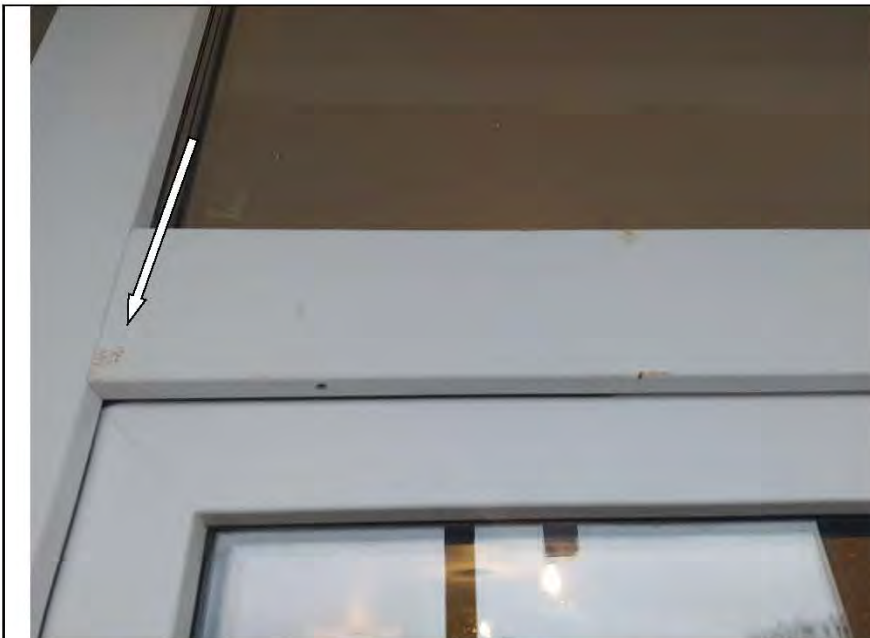
Фото №37. Профиль ПВХ дверного блока в кухне имеет дефекты (загрязнение строительными составами).
