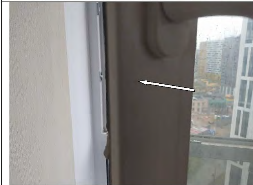
Фото №30. Профиль ПВХ оконного блока №1 в спальне имеет дефекты (загрязнение малярными составами).
