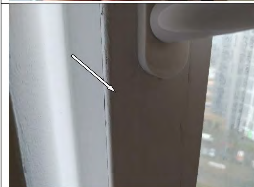
Фото №41. Профиль ПВХ оконного блока №5 в гостиной имеет дефекты (загрязнение малярными составами).
