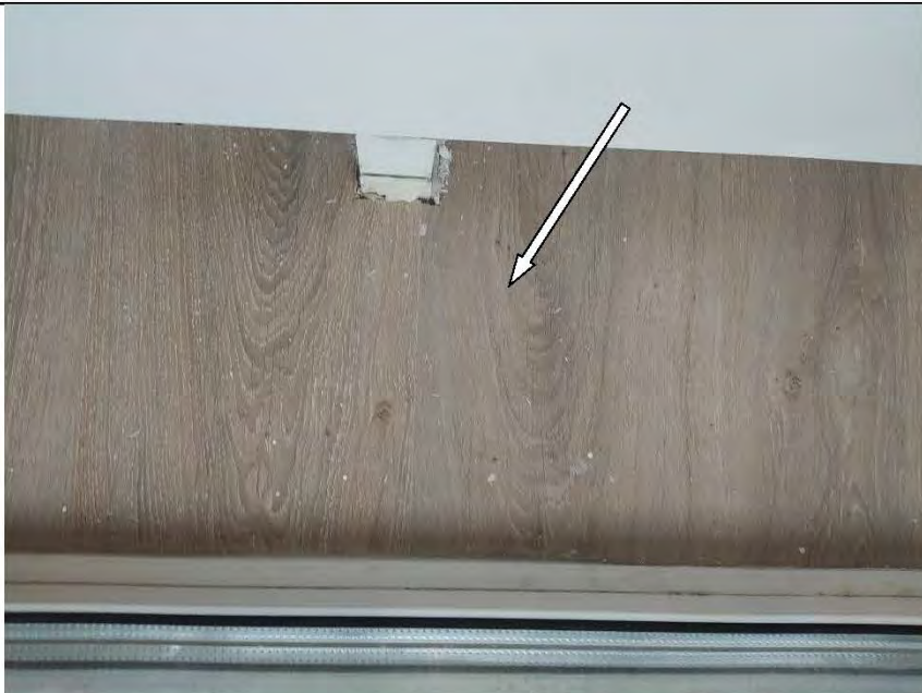
Фото №71. Загрязнения на поверхности ламината в кухне.
