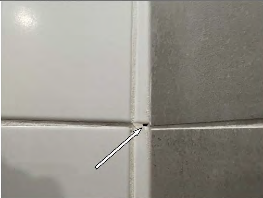
Фото №22. Пропуски затирочного раствора в швах настенной керамической плитки в ванной комнате.
