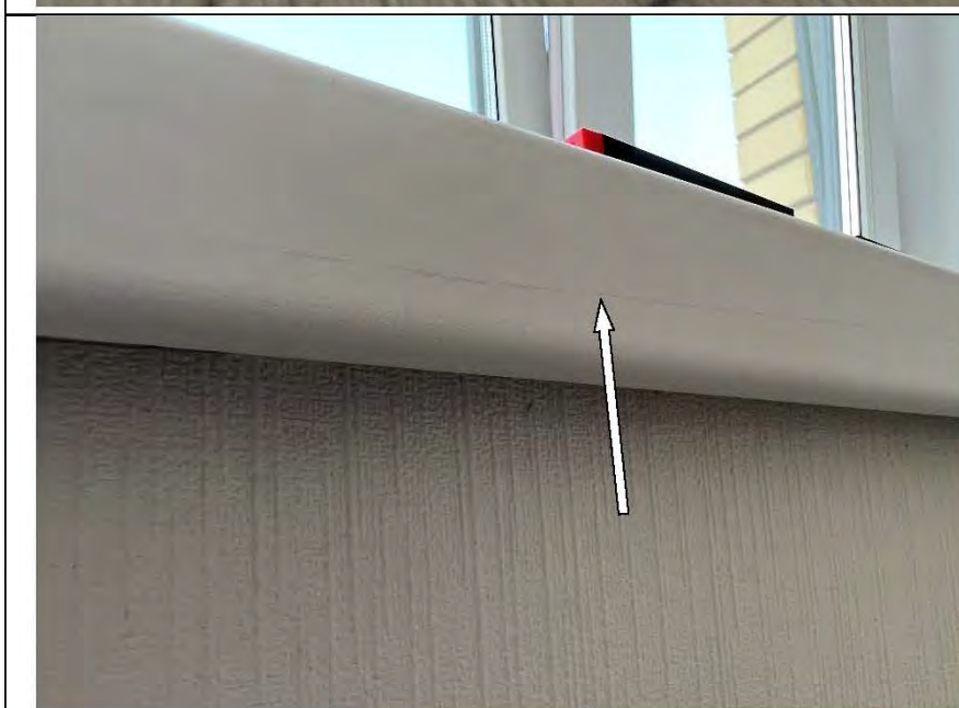
Фото №30. Царапина на лицевой поверхности подоконной доски в спальне.
