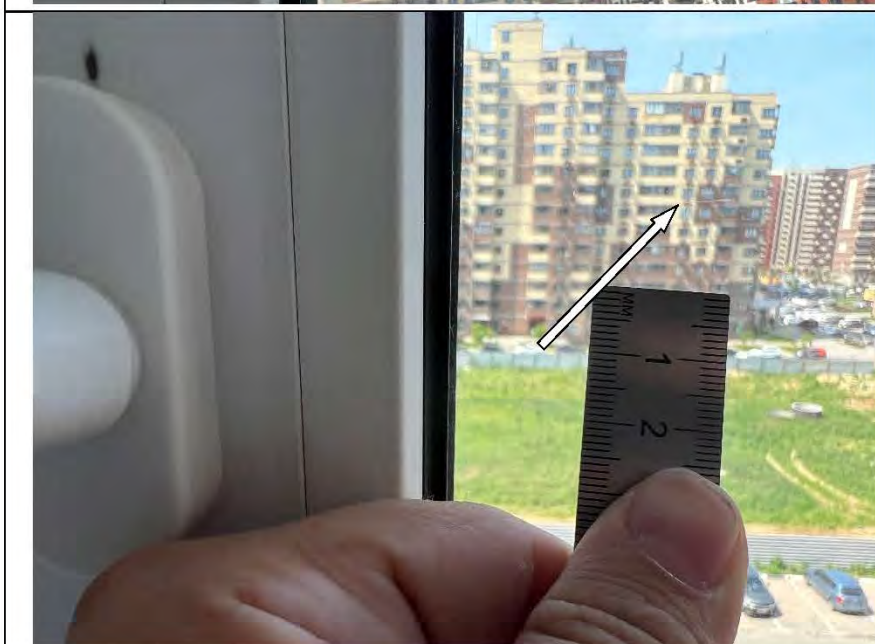
Фото №36. Царапины на стеклопакете оконного блока ПВХ в кухне.
