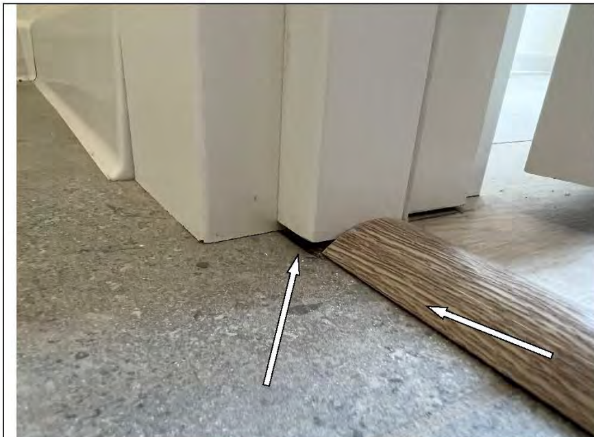
Фото №58. Коротко подрезан короб дверного блока в кухне.
