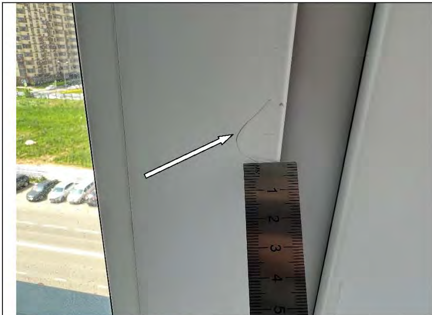
Фото №40. Механическое повреждение (царапины) профиля ПВХ оконного блока в кухне.
