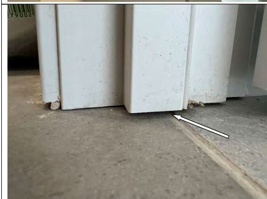
Фото №57. Коротко подрезан короб дверного блока в ванной комнате.
