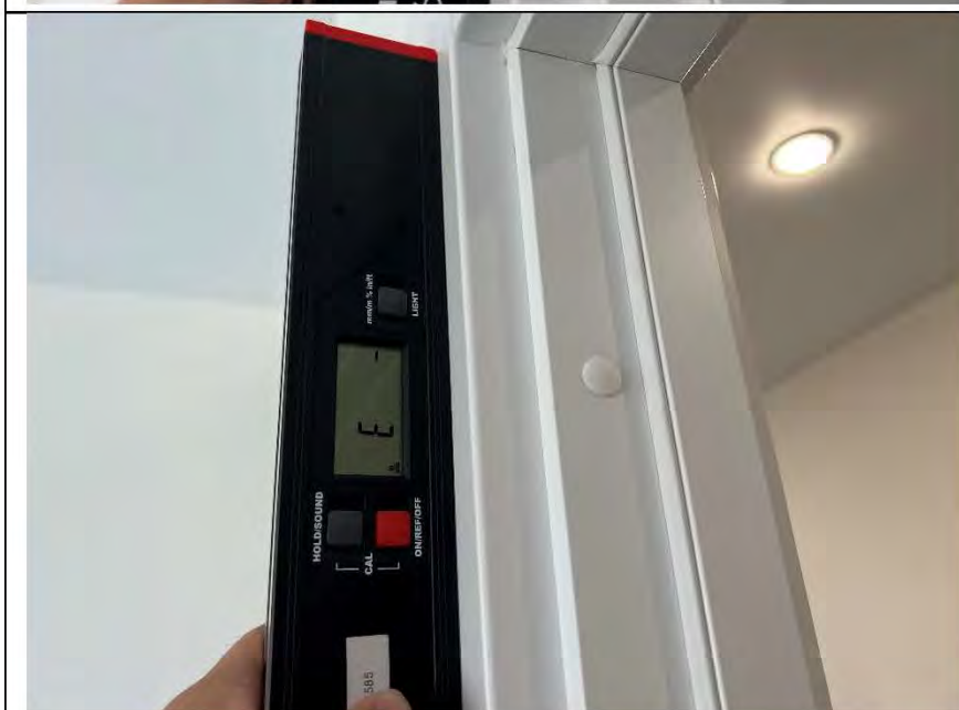
Фото №53. Отклонение наличников дверного блока в кухне равно 3 мм.
