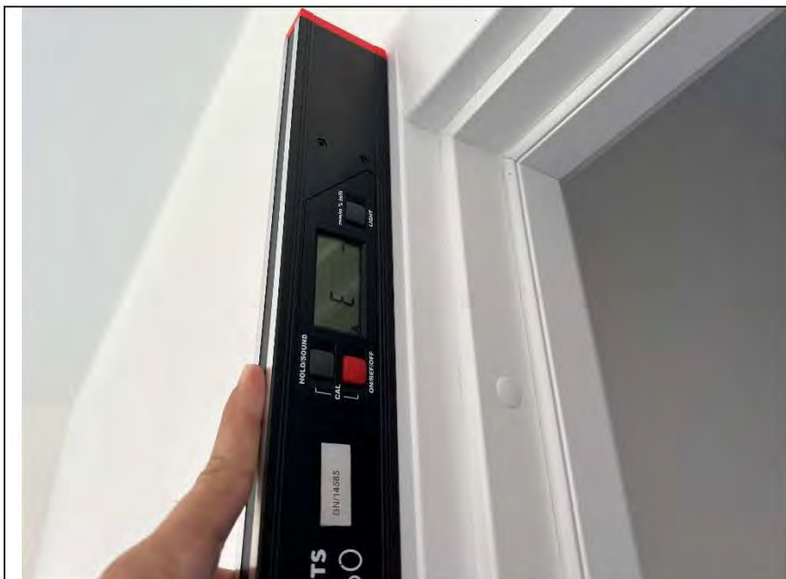
Фото №52. Отклонение наличников дверного блока в спальне равно 3 мм.
