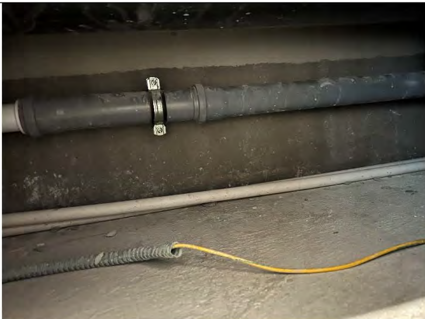
Фото №19. Отсутствует настенная и напольная керамическая плитка за ванной.
