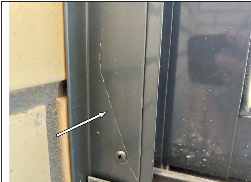
Фото №43. Царапина на лицевой поверхности металлического профиля оконного блока на лоджии.
