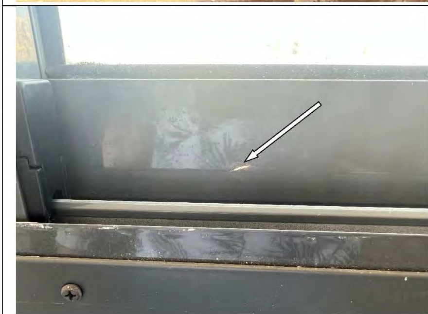
Фото №45. Царапина на лицевой поверхности металлического профиля оконного блока на лоджии.
