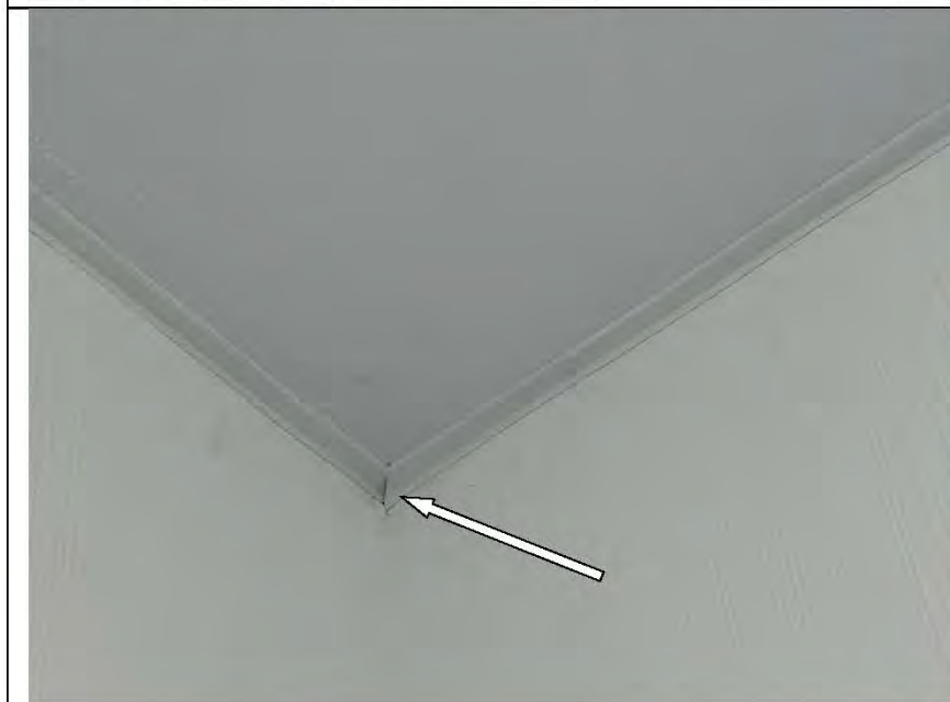
Фото №50. Зазор в стыке декоративного молдинга крепления натяжного потолка в прихожей.
