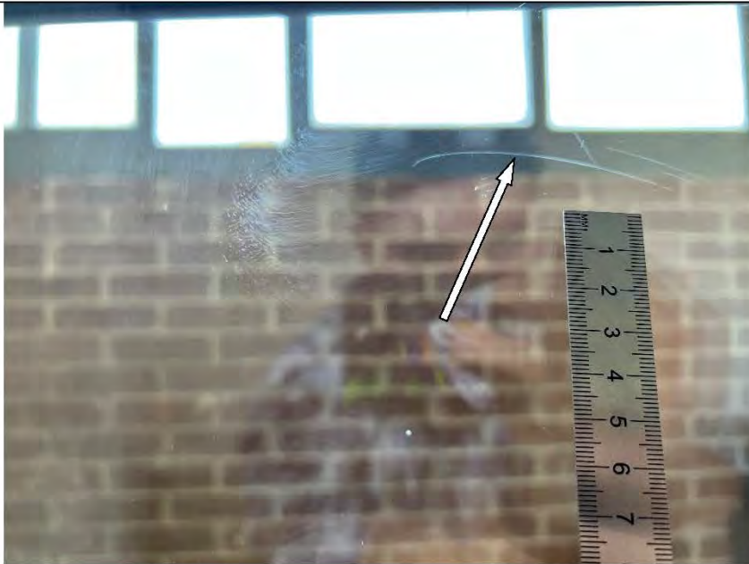
Фото №37. Царапины на стеклопакете оконного блока ПВХ в кухне.
