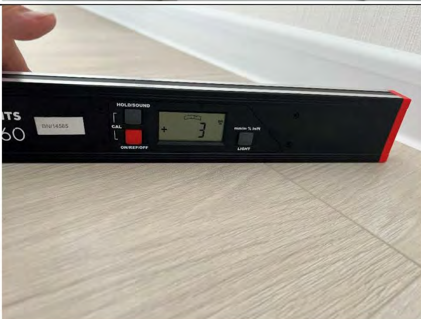
Фото №24. Измерение уровня напольного покрытия в спальне.
