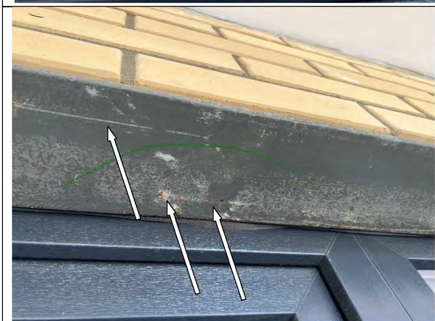
Фото №47. Царапины и следы коррозии на лицевой поверхности металлической перемычки оконного блока на лоджии.
