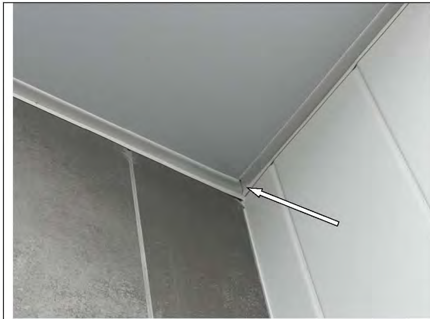
Фото №49. Зазор в стыке декоративного молдинга крепления натяжного потолка в ванной комнате.
