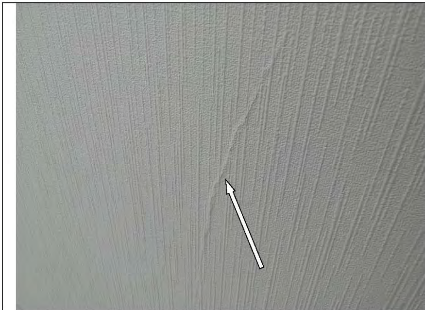
Фото №16. Отслоение обоевого полотна от поверхности стены в спальне.
