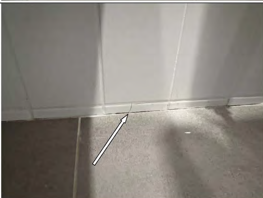
Фото №21. Царапины на лицевой поверхности настенной керамической плитки в ванной комнате.
