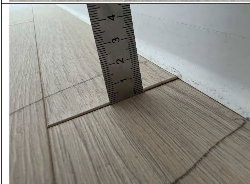
Фото №29. Поднятые кромки досок ламината в спальне.
