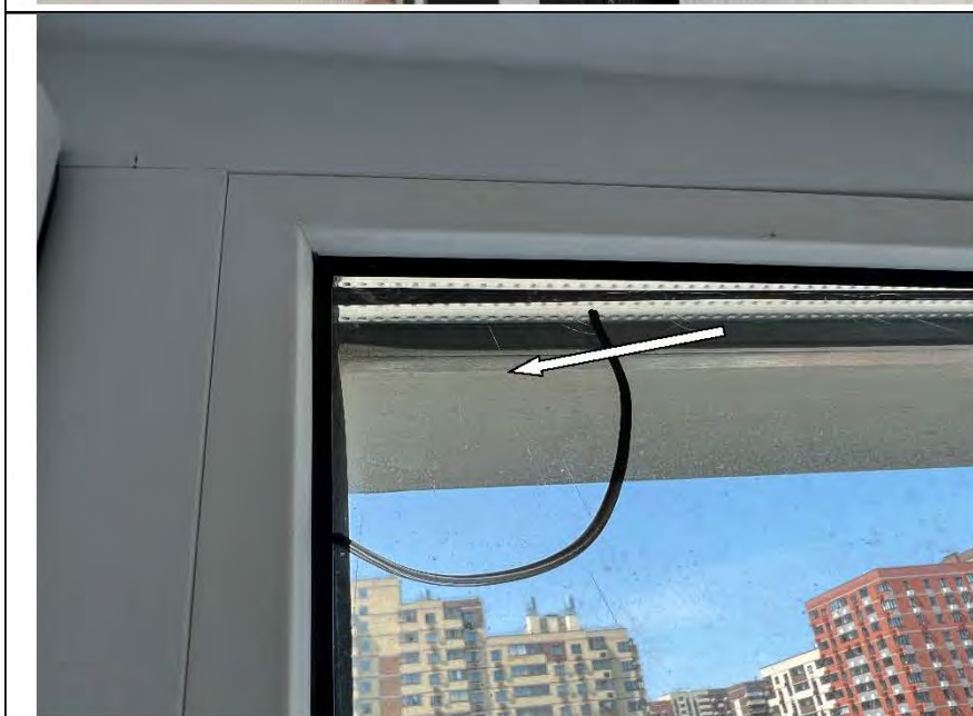
Фото №35. Царапины на стеклопакете оконного блока ПВХ в спальне.
