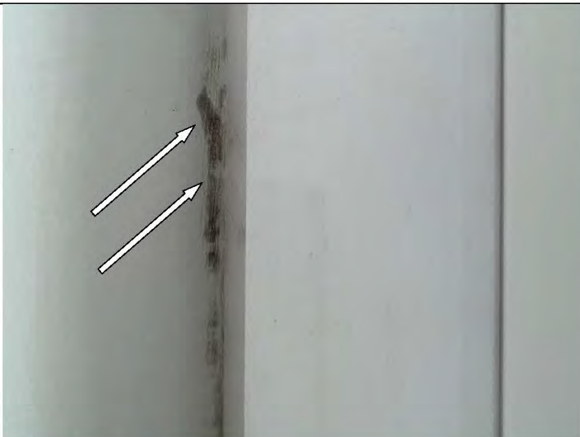
Фото №23. Следы поражений грибком на откосах оконного блока ПВХ в кухне.
