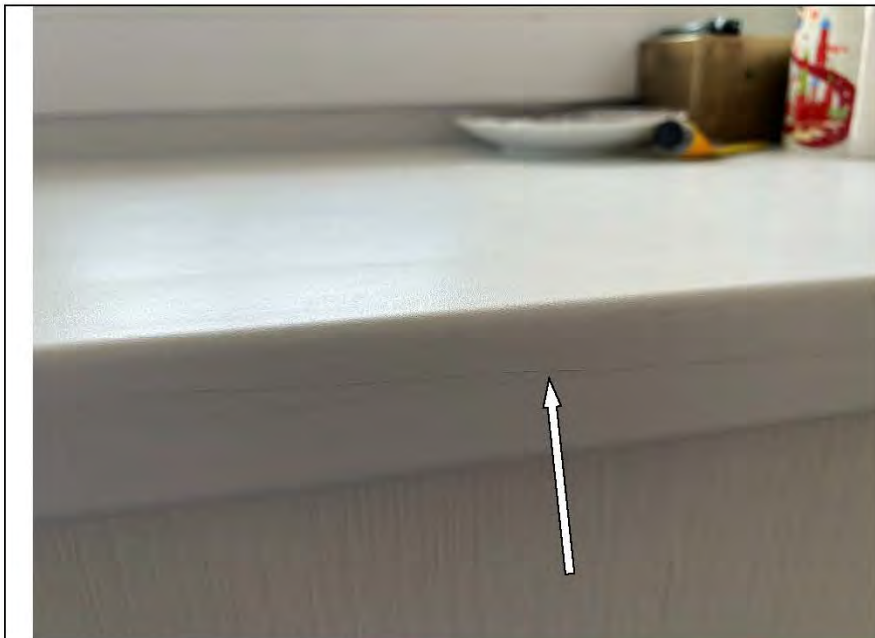
Фото №31. Царапина на лицевой поверхности подоконной доски в кухне.
