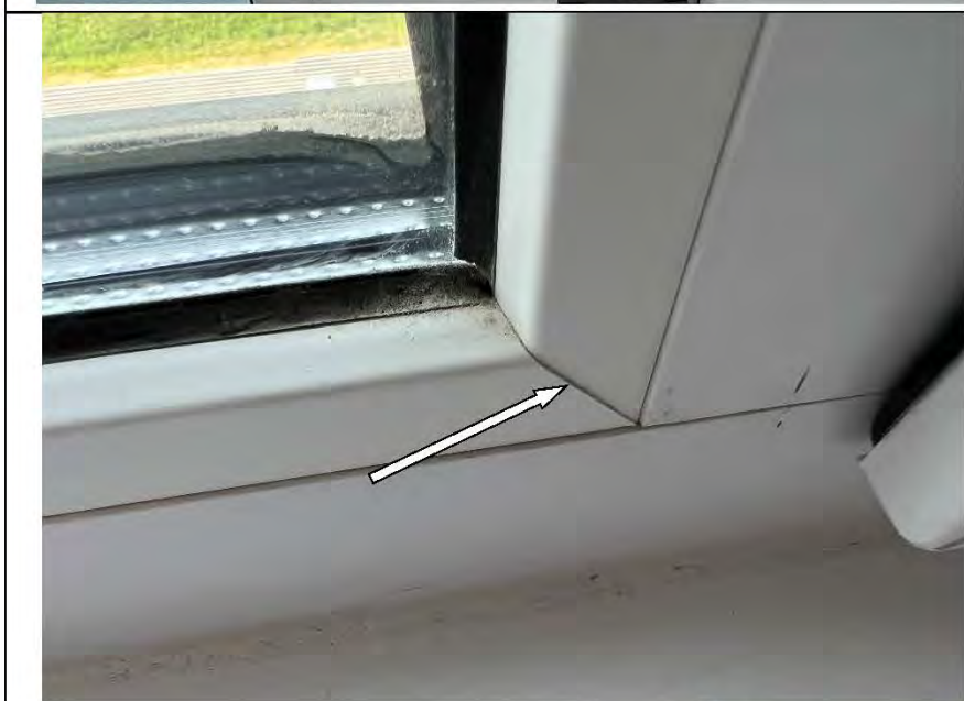
Фото №41. Зазор в стыке профилей оконного блока ПВХ в спальне.
