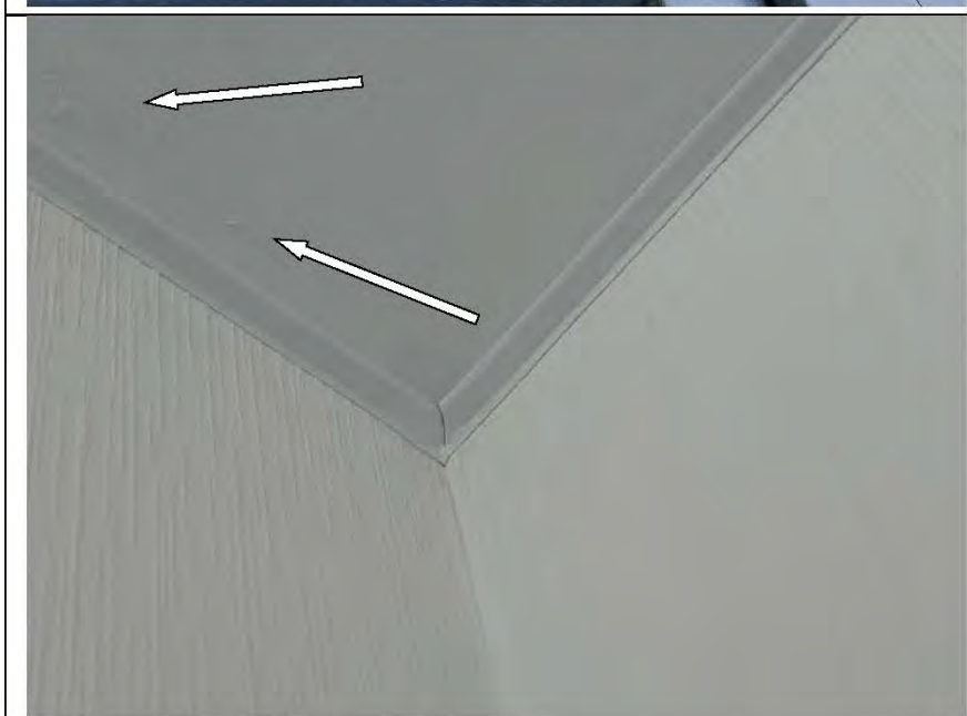
Фото №48. Загрязнение полотна натяжного потолка в спальне.
