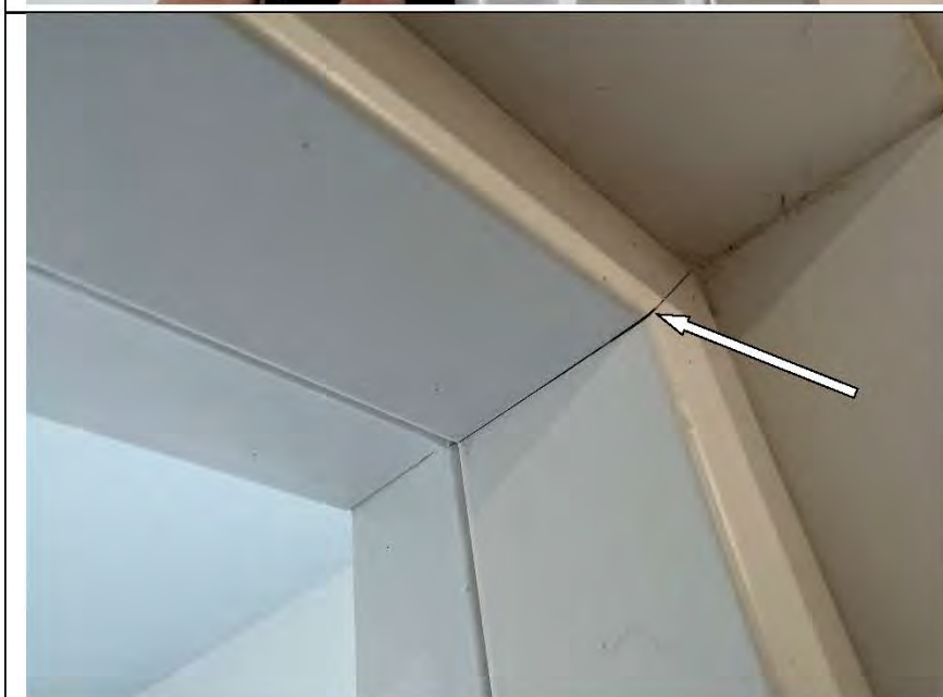
Фото №54. Элементы дверного блока соединены не надежно в ванной комнате (коробка).
