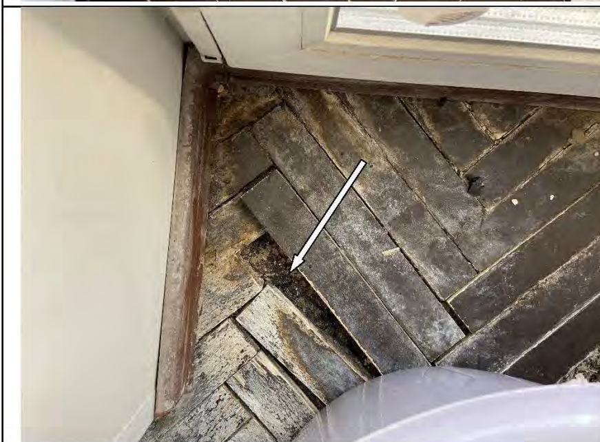
Фото №18. Поражение грибком вздутие кромок досок паркета (штучного) и в кабинете.
