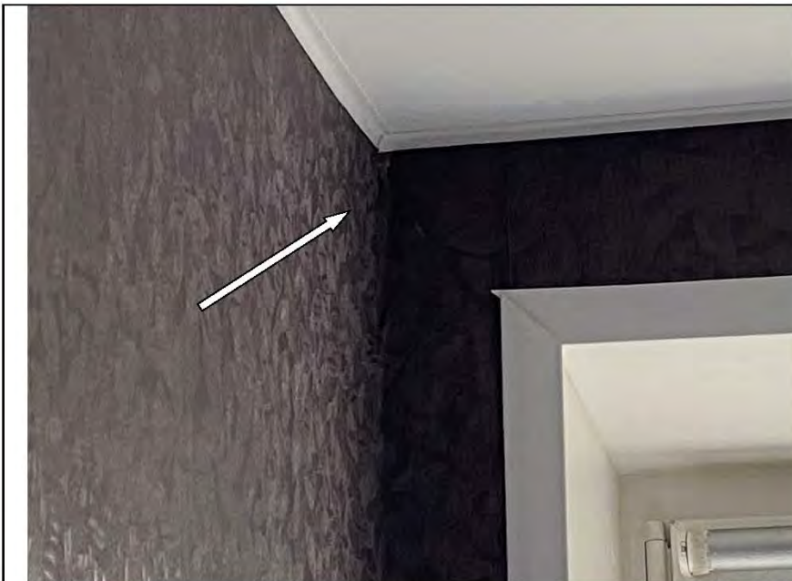
Фото №13. Следы залития на стенах и поражение грибком, оклеенных обоями, в спальне в квартире.
