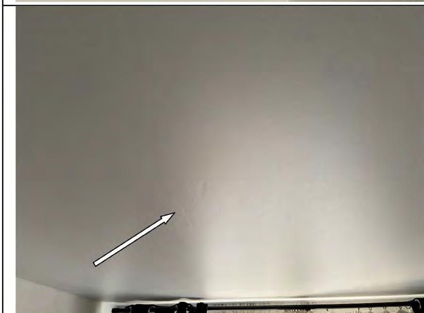
Фото №23. Следы залития на поверхности натяжного потолка в кабинете.
