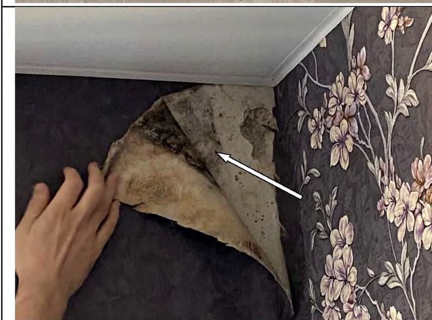
Фото №12. Следы залития на стенах и поражение грибком, оклеенных обоями, в спальне в квартире.
