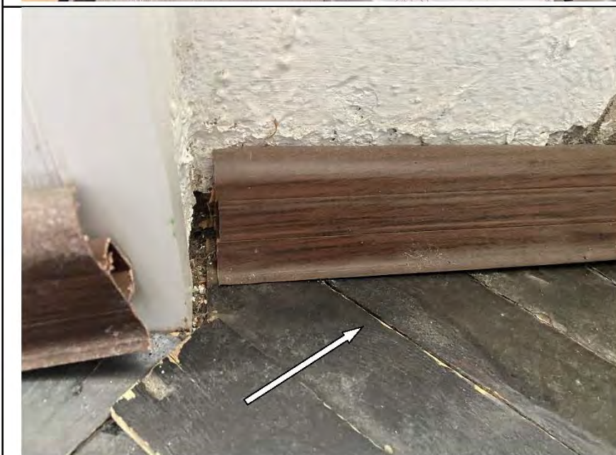
Фото №15. Поражение грибком вздутие кромок досок паркета (штучного) в кабинете.
