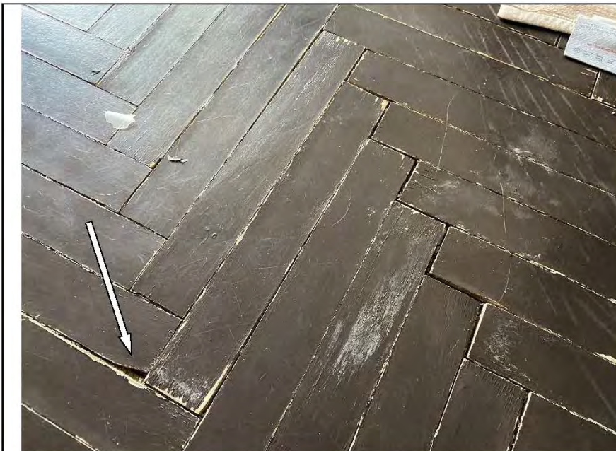
Фото №19. Поражение грибком вздутие кромок досок паркета (штучного) в кабинете.
