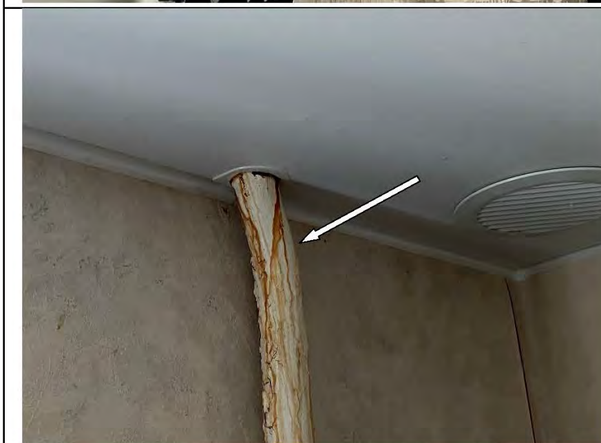
Фото №24. Следы залития, коррозии на поверхности окрашенных труб отопления в кабинете.
