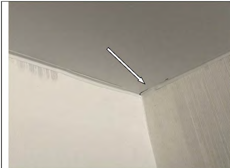
Фото №22. Следы залития на поверхности натяжного потолка в кабинете.
