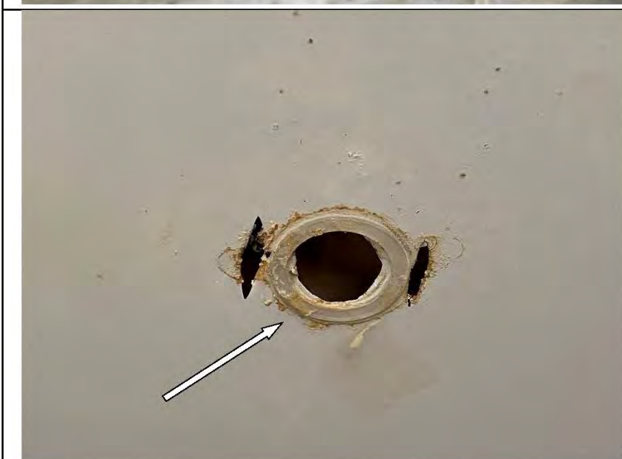
Фото №21. Следы залития на поверхности натяжного потолка в кабинете.
