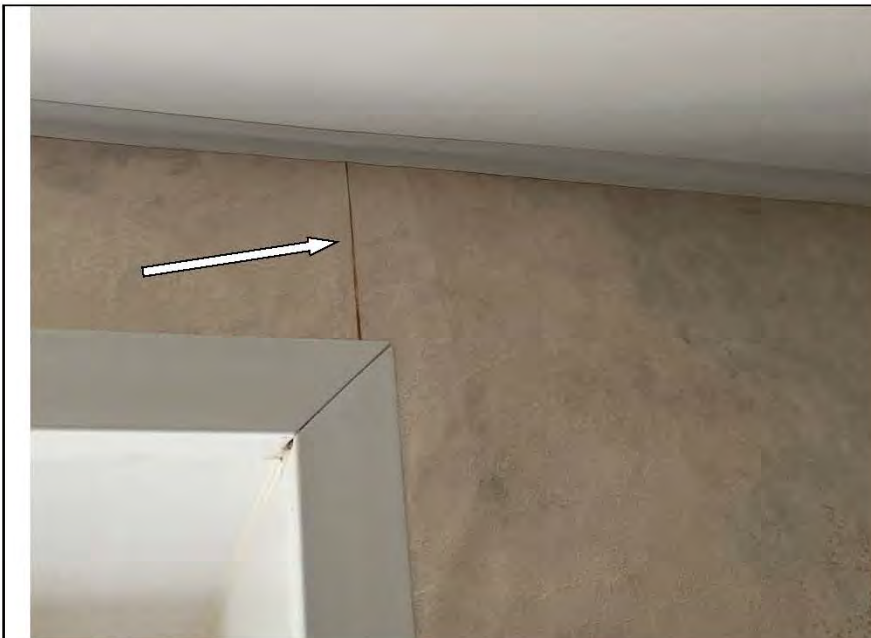
Фото №10. Следы залития на стенах и поражение грибком, оклеенных обоями, в кухне в квартире.
