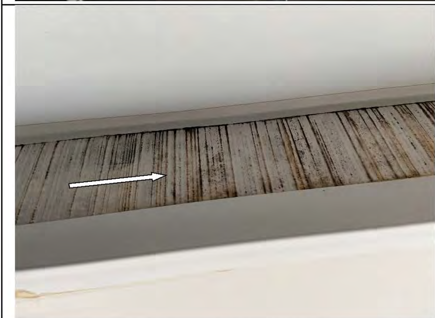
Фото №6. Следы заливания на стенах и поражение грибком, оклеенных обоями, в кабинете в квартире.
