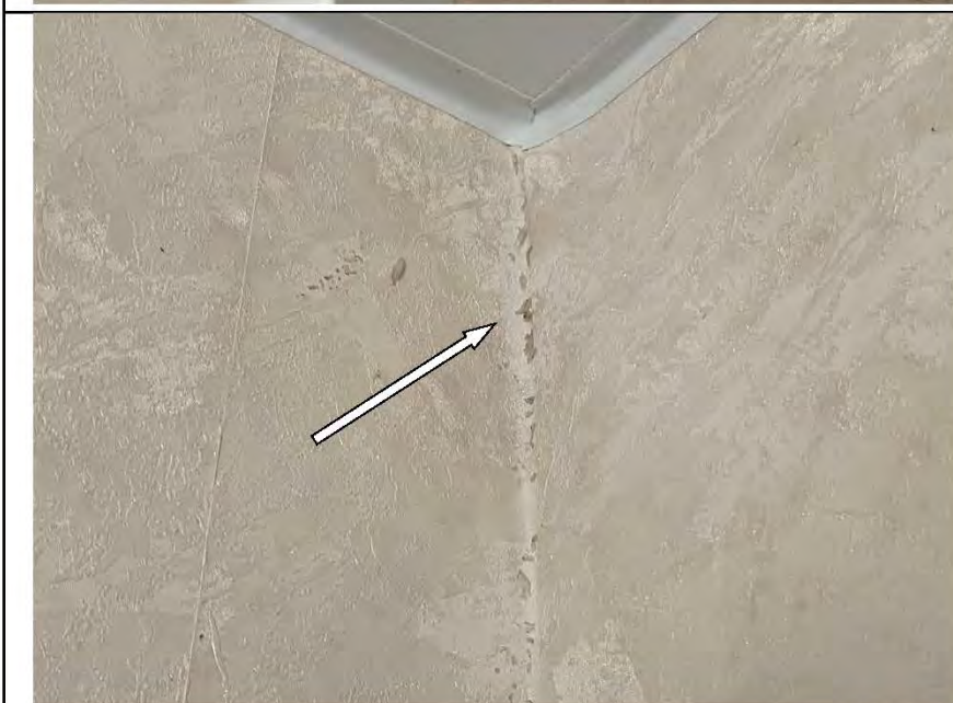
Фото №11. Следы залития на стенах и поражение грибком, оклеенных обоями, в кухне в квартире.
