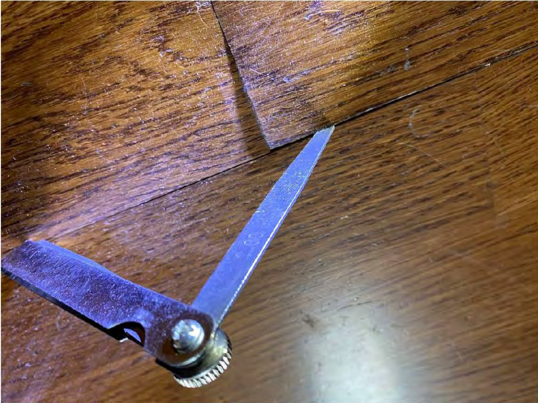
Фото 11-13. Кухня. Пол, набухание кромок паркета, образование уступа и зазора
