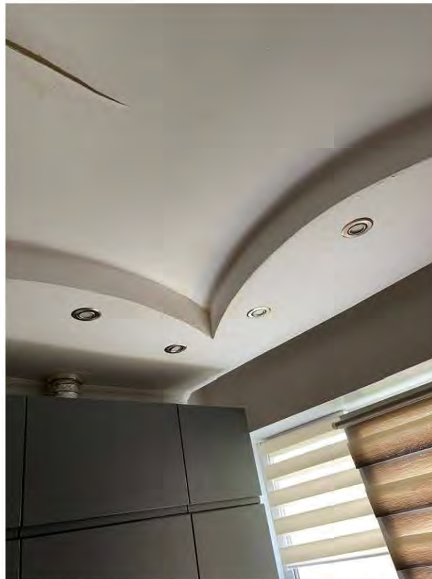
Фото 6-8. Кухня. Потолок, наличие разводов, отслоение окрасочного слоя от основания.
