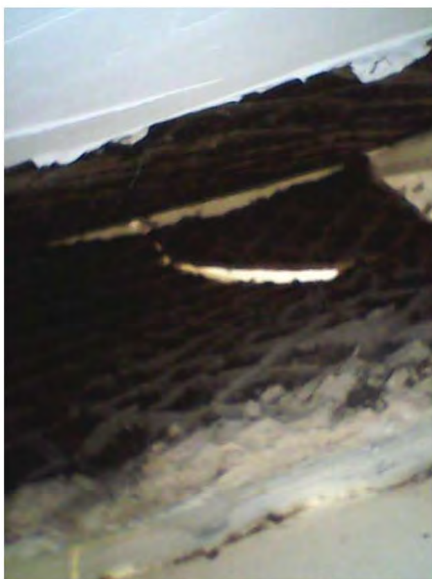
Фото 15-17. Комната 1. Потолок, отслоение штукатурного слоя в запотолочном пространстве
