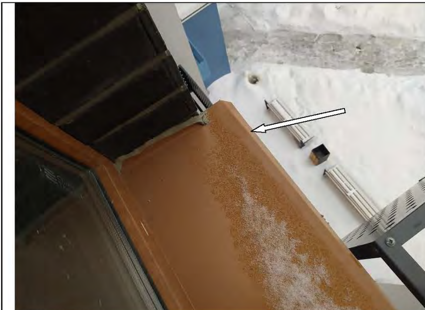
Фото №37. Металлический отлив оконного блока ПВХ в спальне имеет дефект (сильное замятие)
