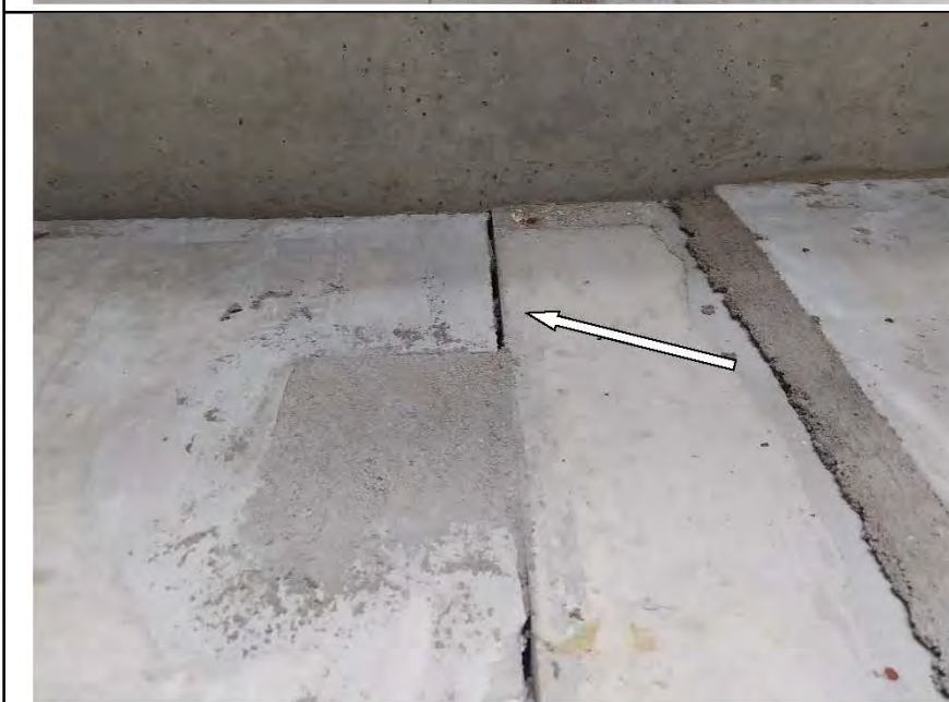
Фото №8. Не заделаны вертикальные швы примыканий на стенах в кухне.
