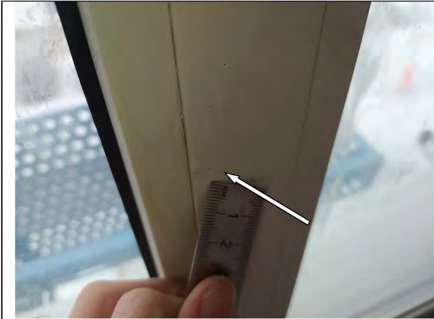
Фото №31. Профиль ПВХ оконного блока №2 в кухне имеет дефекты (царапина).
