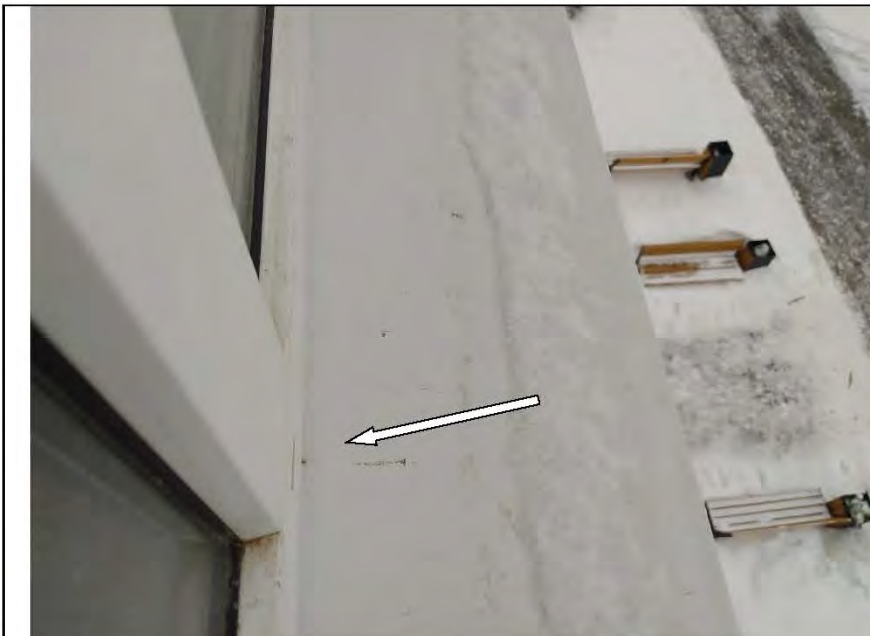
Фото №40. Отсутствуют декоративные козырьки для водосливных отверстий оконного блока из ПВХ №1 в кухне.
