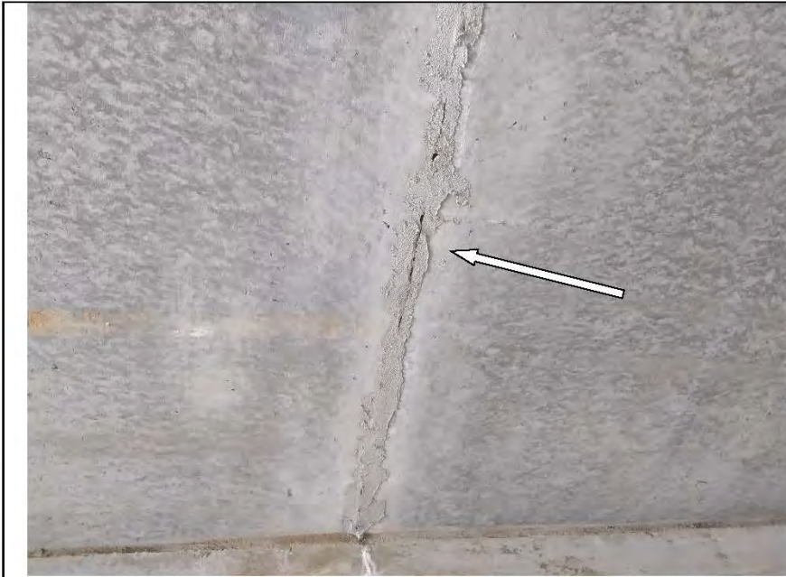
Фото №10. Не заделаны швы в перекрытии в спальне (заделаны некорректно).
