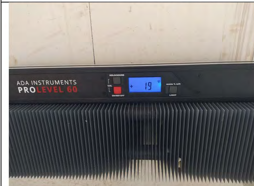
Фото №44. Отопительный прибор смонтирован неровно в спальне.
