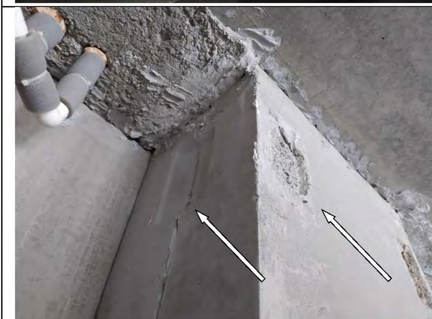
Фото №24. Отсутствует отверстие под вентиляционный канал для санузла.
