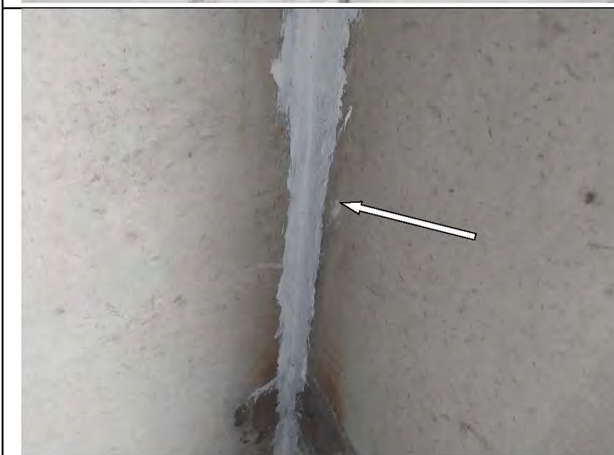
Фото №9. Заделка угловых швов стен в кухне выполнена с дефектами (должна проводиться цементация).
