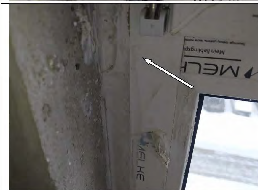
Фото №29. Профиль ПВХ оконного блока №1 в кухне имеет дефекты (загрязнение строительными составами).
