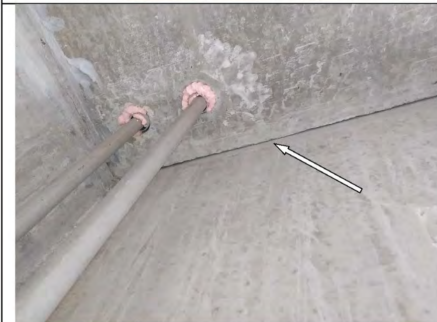
Фото №11. Не заделаны швы в местах соединений стен и перекрытия в спальне.
