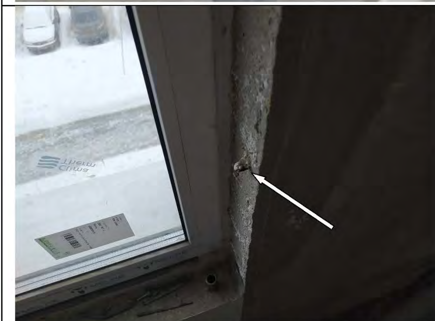
Фото №23. Обнажение арматуры в кухне.
