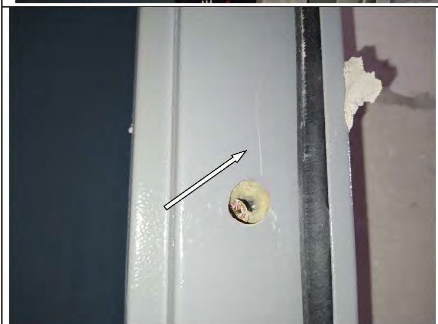
Фото №48. Коробка входной металлической двери имеет дефекты (царапины).
