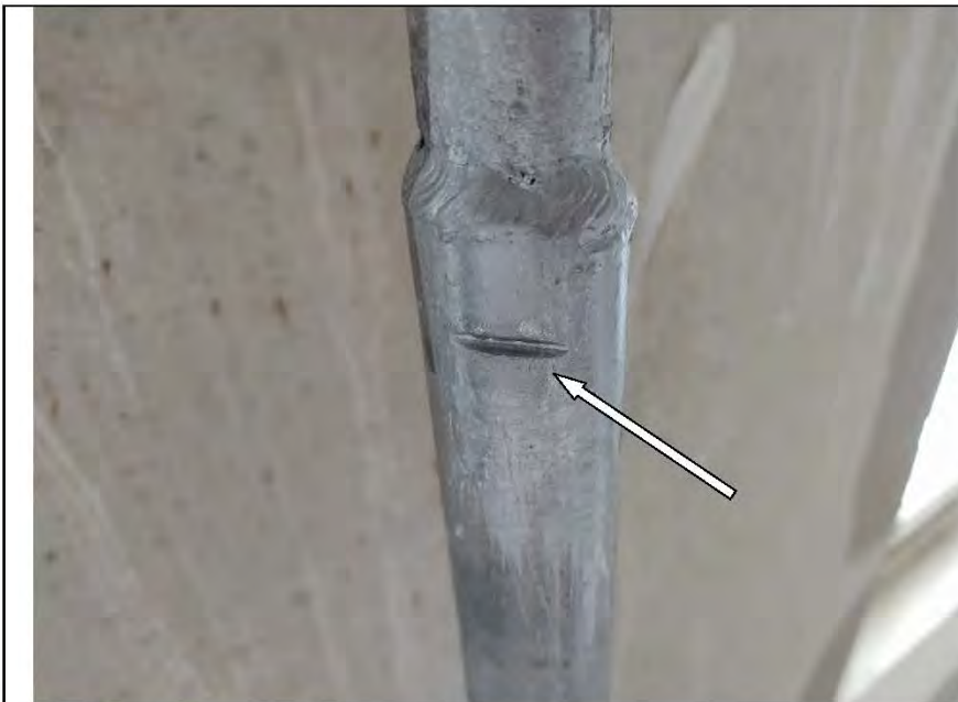
Фото №22. Запил на трубе отопления выводящий стенку за допустимое предельное значение в кухне.
