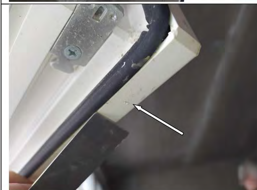
Фото №30. Профиль ПВХ оконного блока №1 в гостиной имеет дефекты (сколы).
