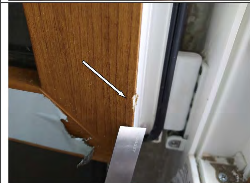
Фото №27. Профиль ПВХ оконного блока в спальне имеет дефекты (скол).
