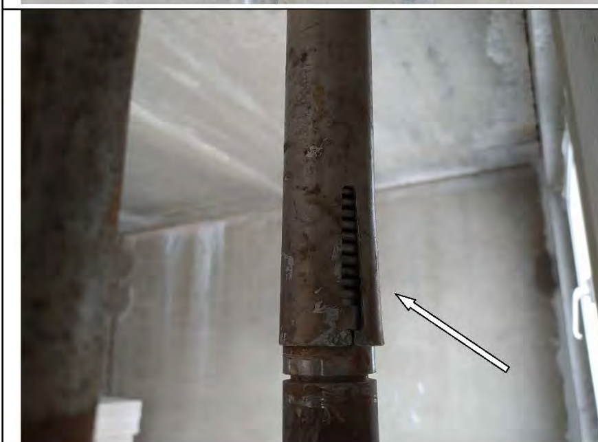
Фото №21. Дефект монтажа сильфонного металлического компенсатора в кухне.
