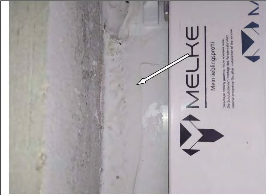
Фото №25. Профиль ПВХ оконного блока в спальне имеет дефекты (загрязнение строительными составами).
