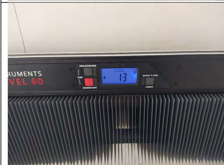
Фото №45. Отопительный прибор №1 смонтирован неровно в кухне.
