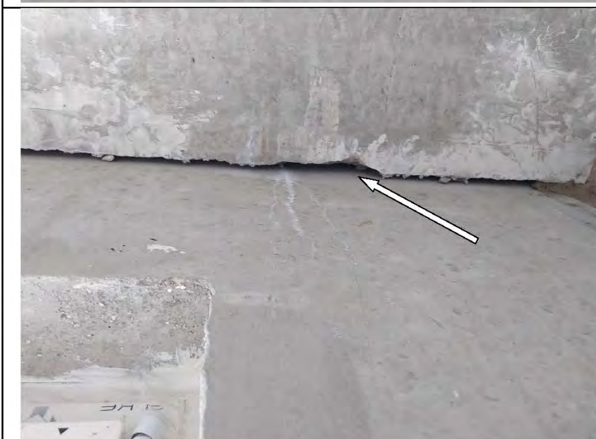
Фото №14. Сколы ребер железобетонного монолитного перекрытия в кухне.
