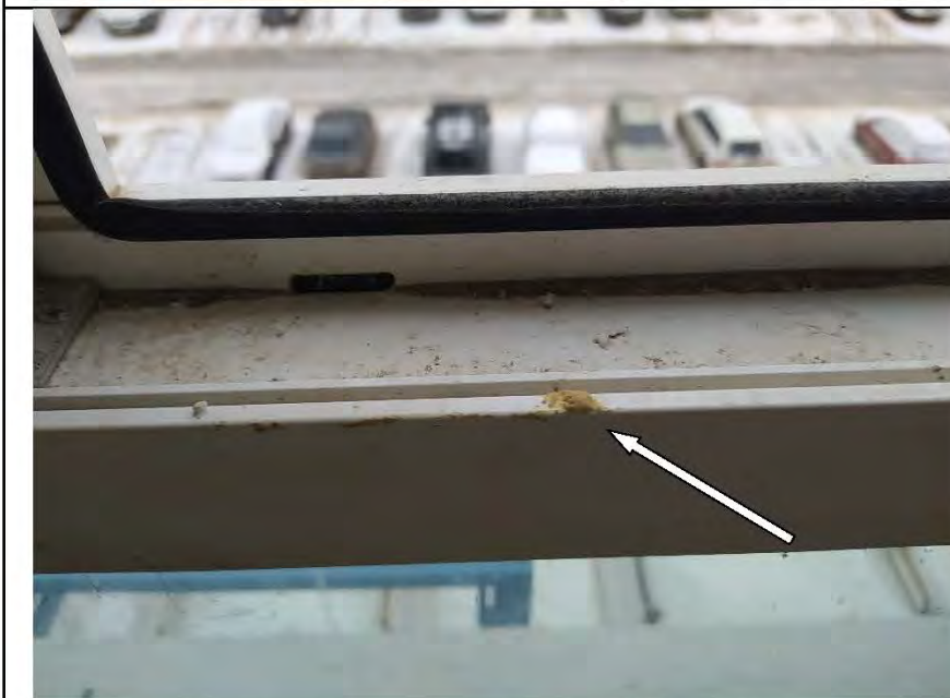
Фото №32. Профиль ПВХ оконного блока №2 в кухне имеет дефекты (загрязнение монтажной пеной).
