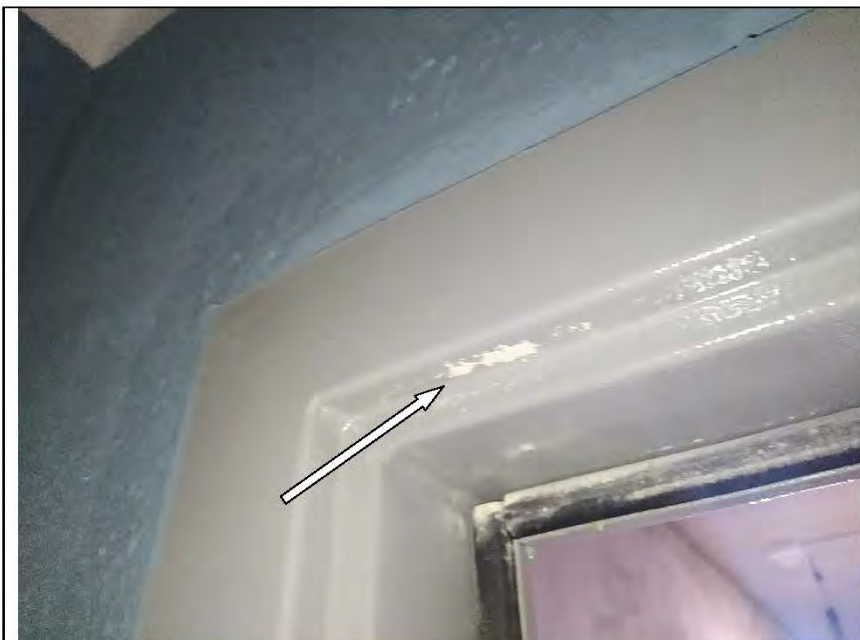
Фото №49. Коробка входной металлической двери имеет дефекты (загрязнение малярными составами)
