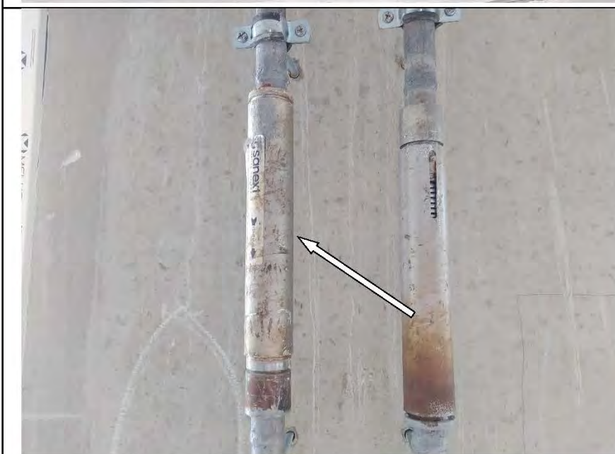
Фото №20. Дефект монтажа сильфонного металлического компенсатора в кухне.
