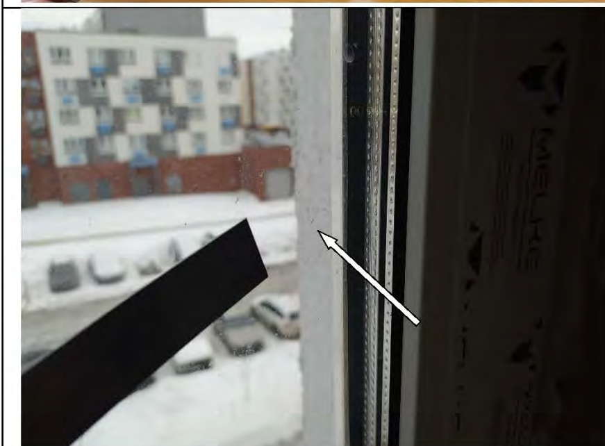
Фото №35. На стеклопакете оконного блока ПВХ №1 в кухне имеется дефект (окалина)
