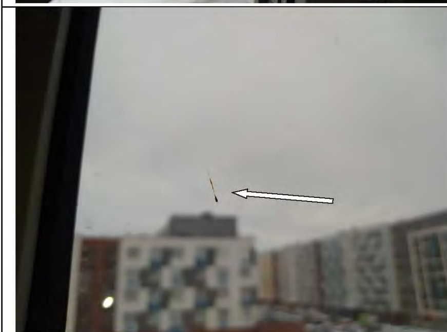
Фото №36. На стеклопакете оконного блока ПВХ №2 в кухне имеется дефект (загрязнения)
