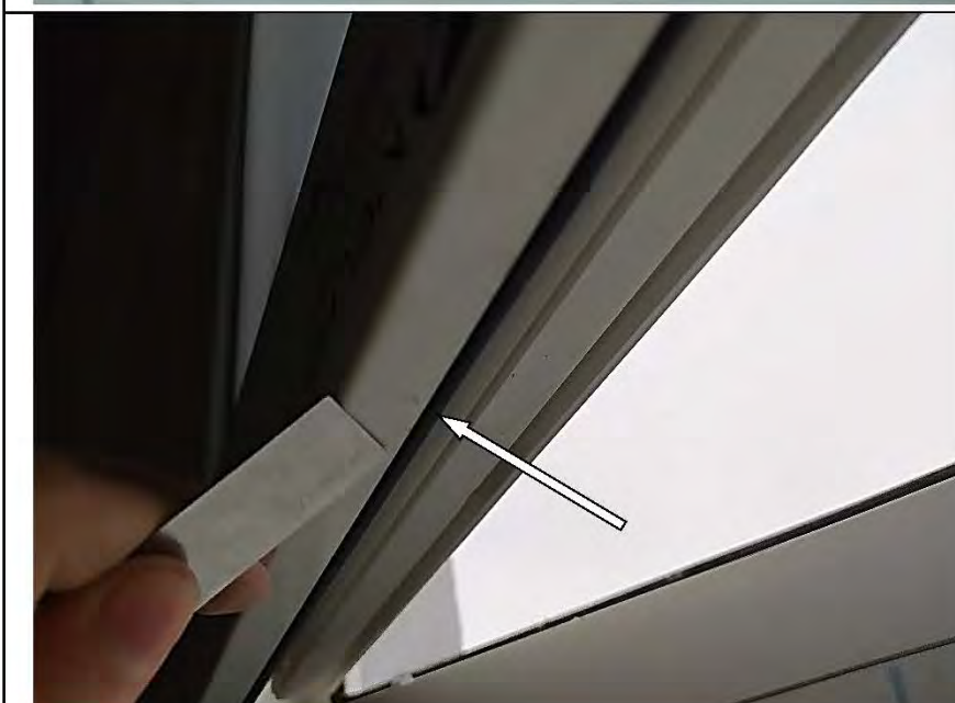
Фото №33. Профиль ПВХ оконного блока №2 в кухне имеет дефекты (скол).
