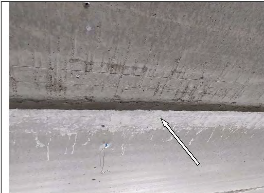
Фото №19. Нарушение прямолинейности нижней плоскости монолитных железобетонных перекрытий в кухне.
