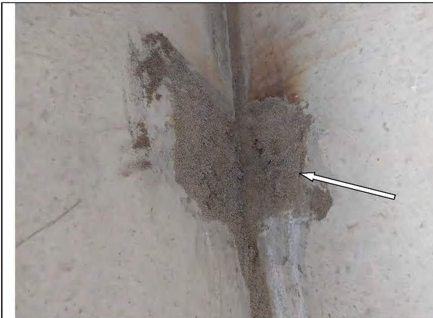
Фото №7. Не удален лишний раствор от заделки неровности стен в кухне.
