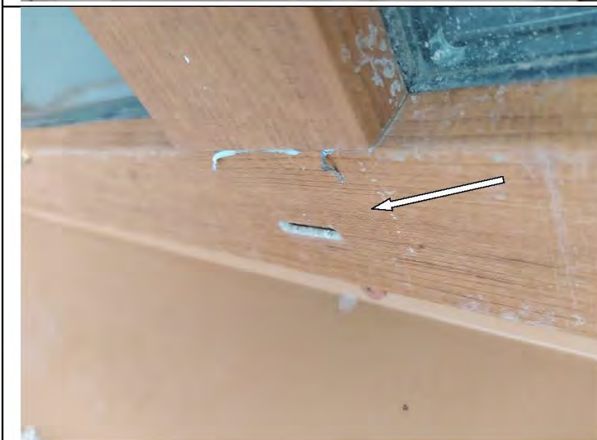
Фото №39. Отсутствуют декоративные козырьки для водосливных отверстий оконного блока из ПВХ в спальне.
