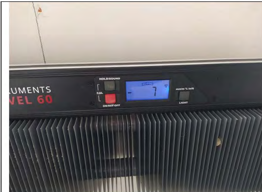
Фото №46. Отопительный прибор №2 смонтирован неровно в кухне.
