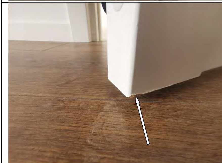
Фото №54. Повреждение ламинации полотна деревянного дверного блока в спальне.
