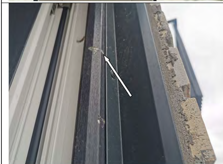
Фото №39. Потертости на профиле ПВХ дверного блока в спальне.
