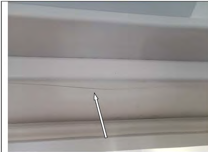
Фото №52. Царапины на коробе деревянного дверного блока в спальне.
