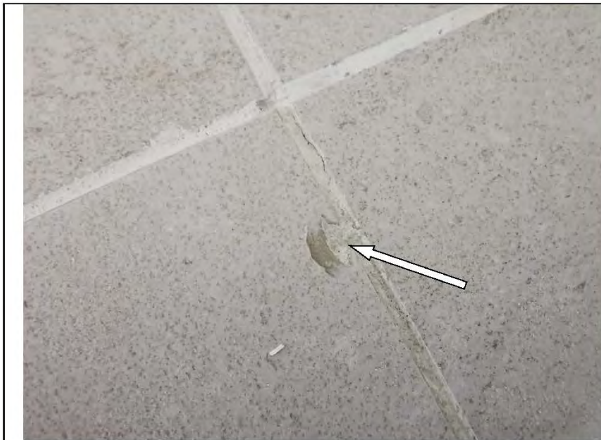
Фото №31. Отбитости на напольной керамической плитке в коридоре.
