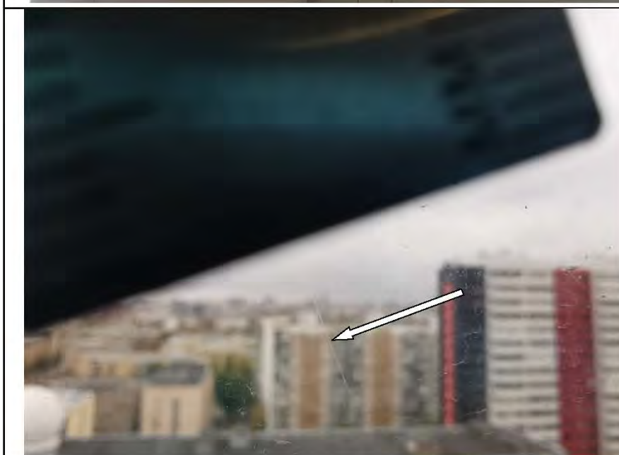
Фото №42. Царапины на стеклопакете оконного блока ПВХ в кухне.
