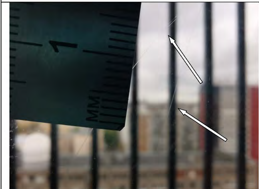
Фото №44. Царапины на стеклопакете дверного блока ПВХ в спальне.
