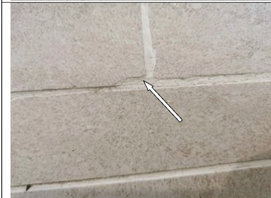
Фото №32. Отбитости на напольной керамической плитке в ванной комнате..
