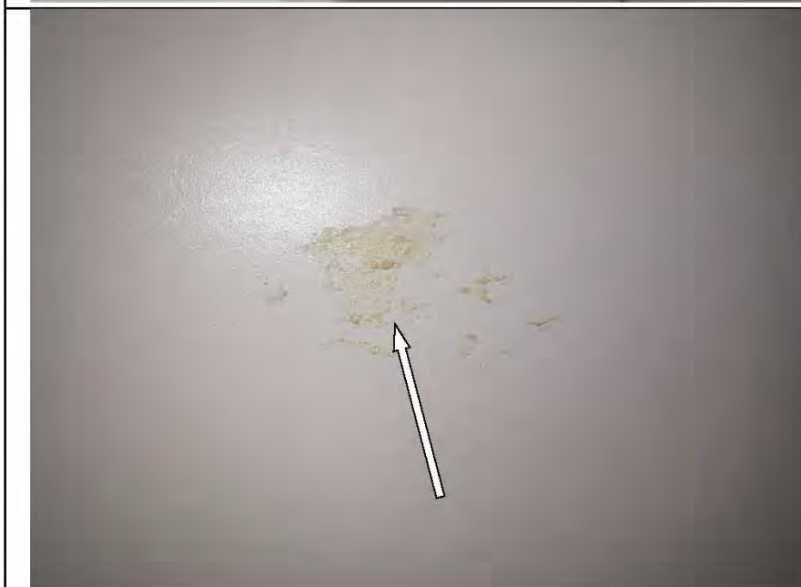
Фото №57. Загрязнение на полотне входного дверного блока.
