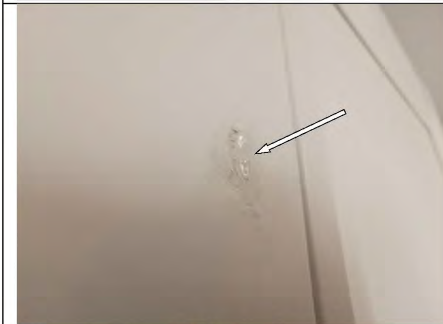
Фото №53. Загрязнение полотна деревянного дверного блока в спальне.
