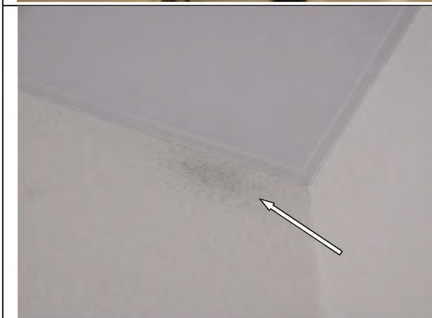
Фото №14. Загрязнение обойного полотна в кухне.
