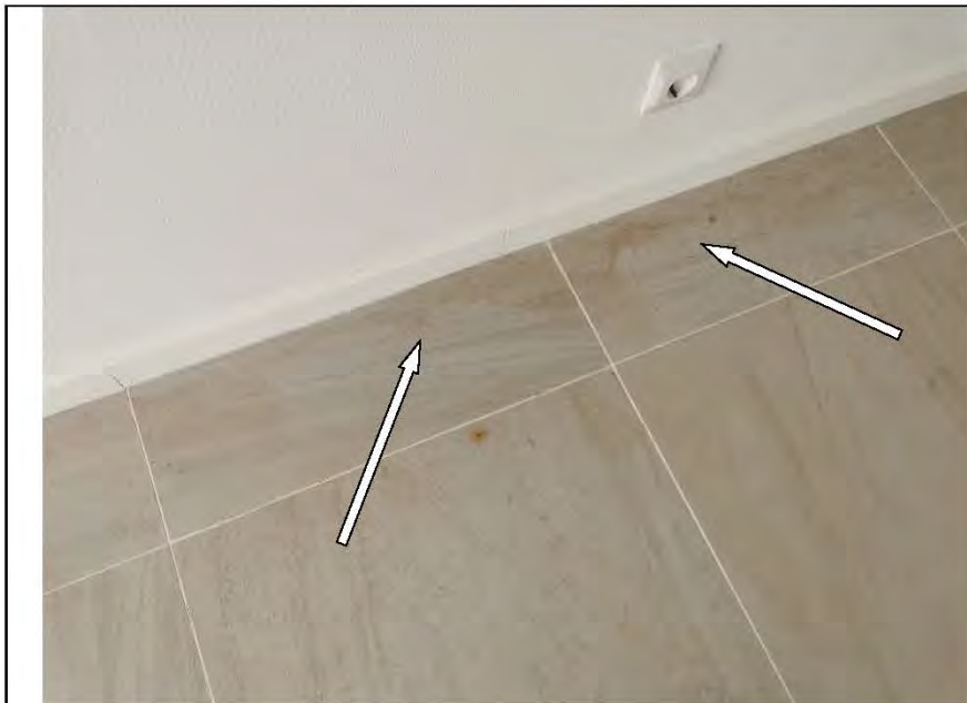
Фото №34. Загрязнение напольной керамической плитки в кухне.
