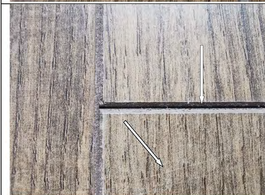
Фото №24. Царапины на ламинате, зазоры между соседними досками ламината в спальне.
