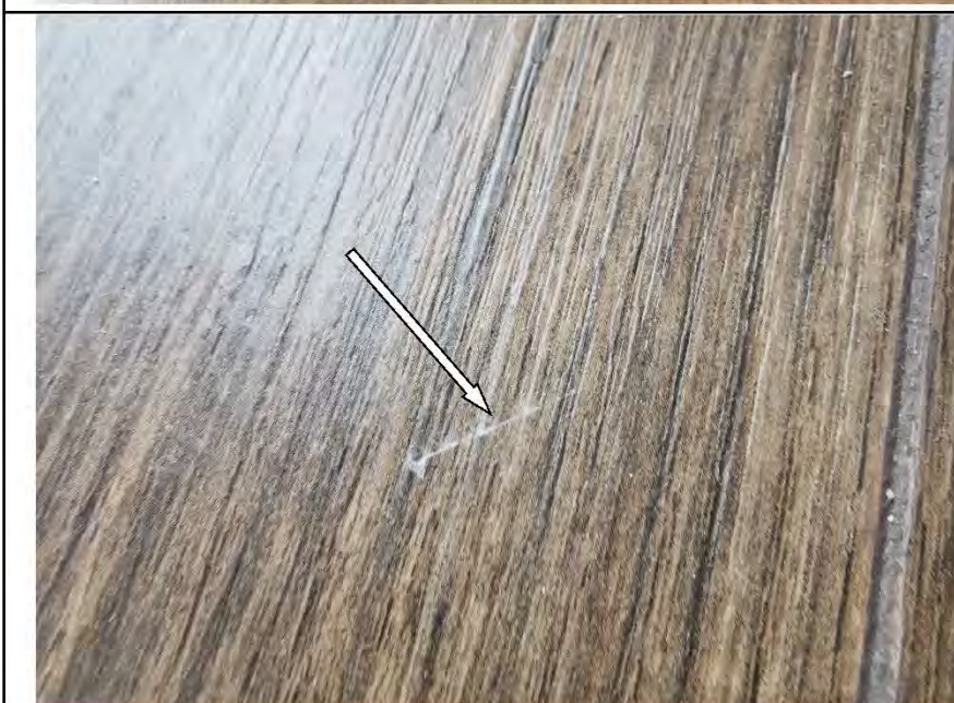
Фото №23. Царапины на ламинате в спальне.
