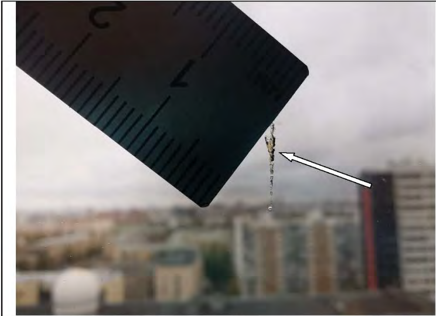
Фото №43. Окалины на стеклопакете оконного блока ПВХ в кухне.
