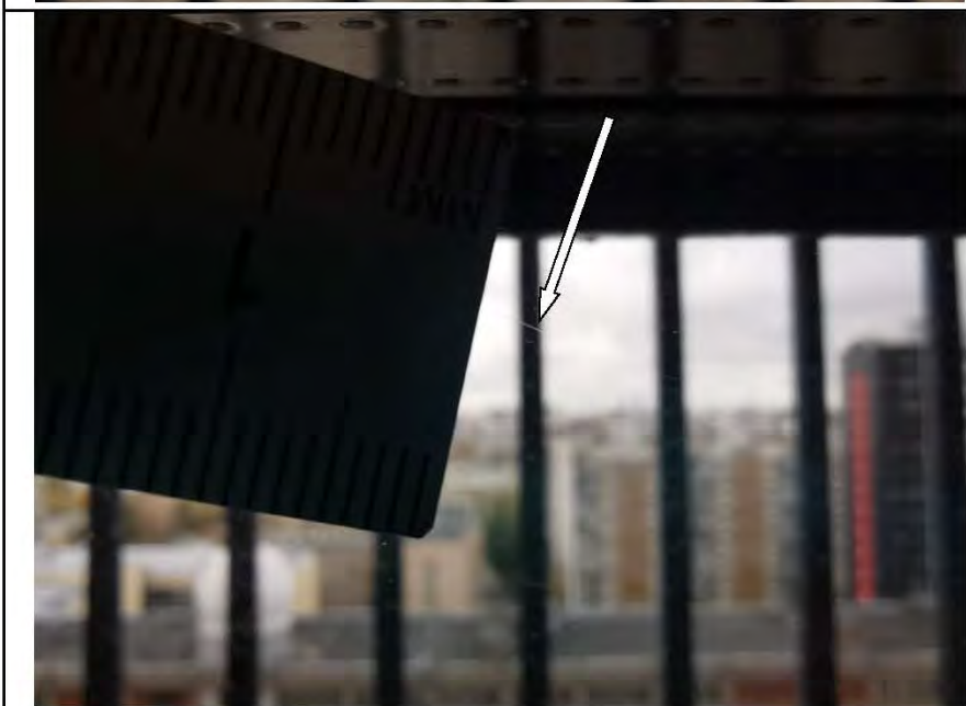
Фото №45. Царапины на стеклопакете дверного блока ПВХ в спальне.
