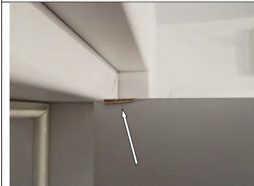
Фото №50. Повреждение ламинации полотна деревянного дверного блока в ванной комнате.
