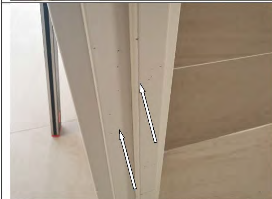
Фото №51. Загрязнение короба деревянного дверного блока в ванной комнате.
