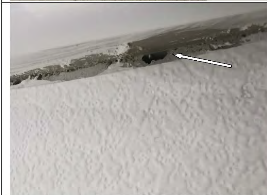
Фото №48. Отверстие под подоконником в кухне не загерметизировано.
