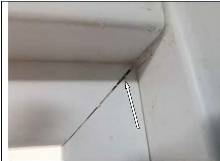
Фото №55. Элементы дверного блока (короба) соединены не надежно в ванной комнате.
