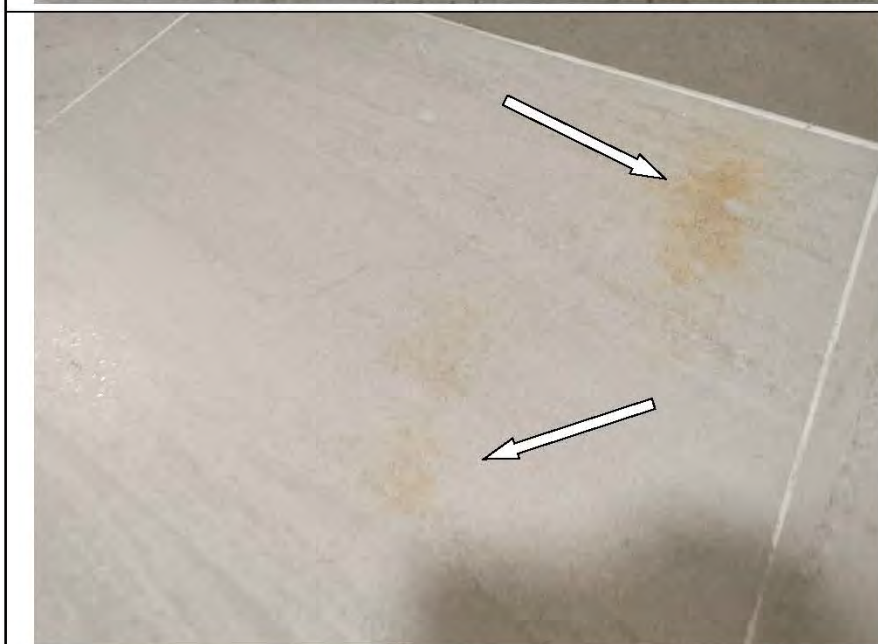
Фото №33. Загрязнение напольной керамической плитки в ванной комнате.
