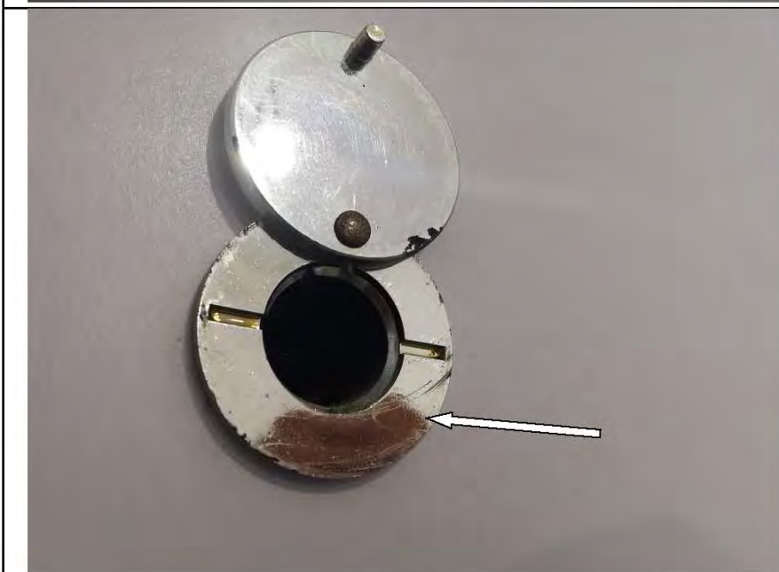
Фото №60. Потертости на фурнитуре входного дверного блока.
