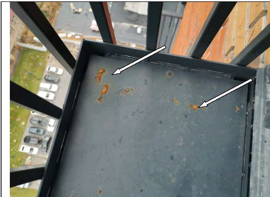
Фото №61. Коррозия на металлическом настиле балкона.
