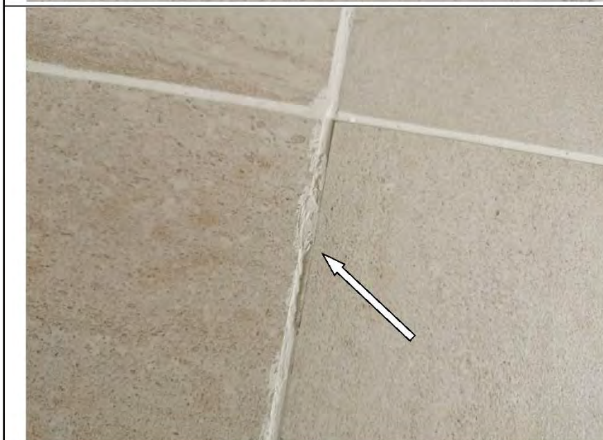
Фото №29. Неравномерное заполнение шовного пространства напольной керамической плитки затиручным составом в кухне.
