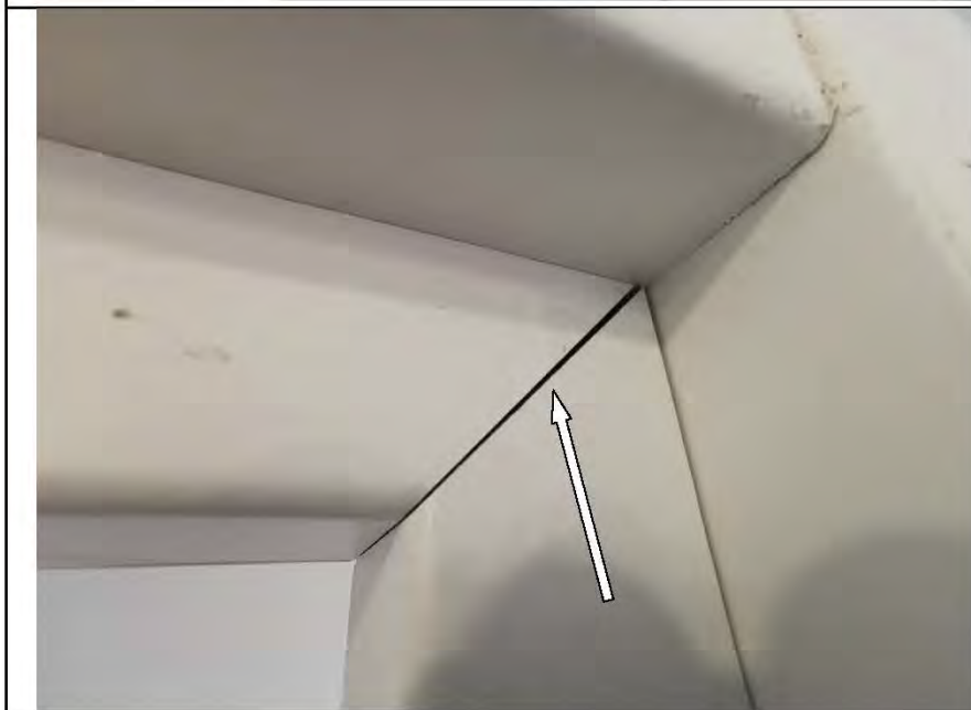
Фото №56. Элементы дверного блока (короба) соединены не надежно в спальне.
