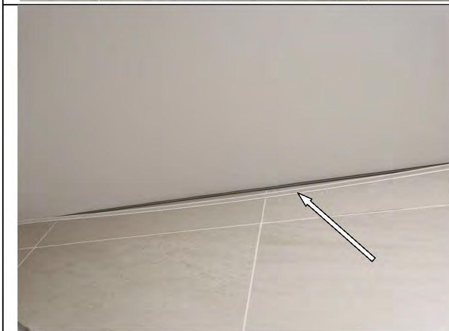
Фото №35. Дефект монтажа декоративного молдинга крепления натяжного потолка в ванной комнате.
