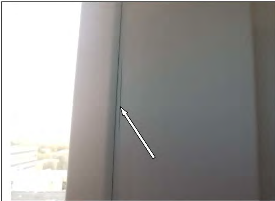
Фото №40. Царапины на профиле ПВХ дверного блока в спальне.
