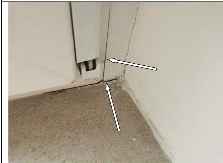
Фото №47. Дверной блок в спальне имеет щели, через которые происходит инфильтрация воздуха и влаги внутрь помещения.
