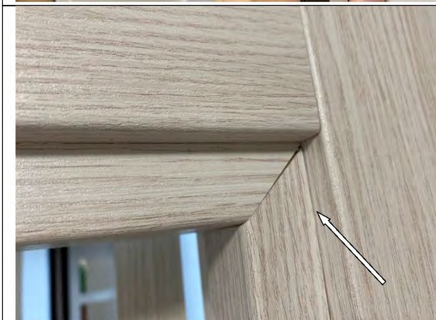
Фото №23. Элементы (коробка) дверного блока соединены не надежно в ванной комнате.
