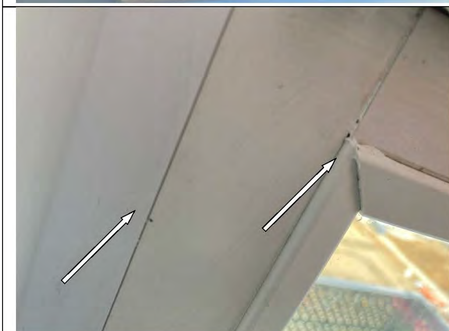
Фото №32. Профиль ПВХ оконного блока в кухне имеет дефекты (зазор).
