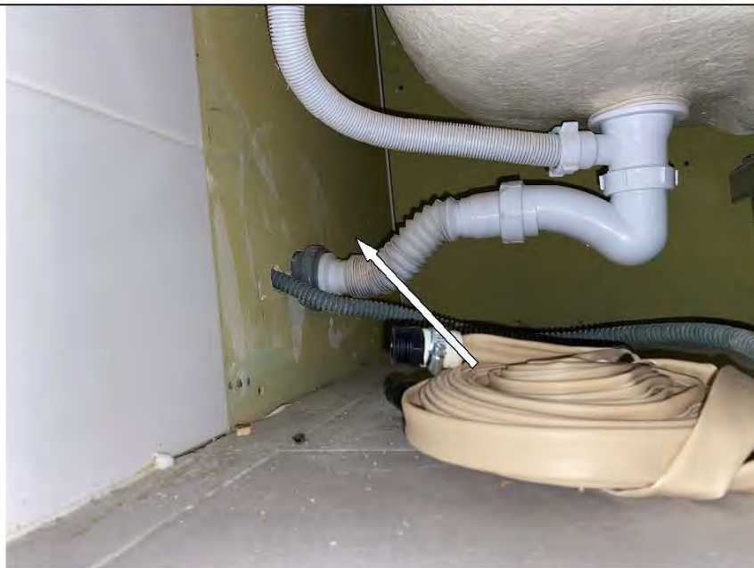
Фото №14. Частично отсутствует настенная керамическая плитка за ванной.
