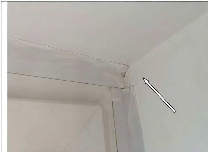
Фото №28. Окрашенные откосы оконного блока ПВХ в кухне выполнены с дефектами.
