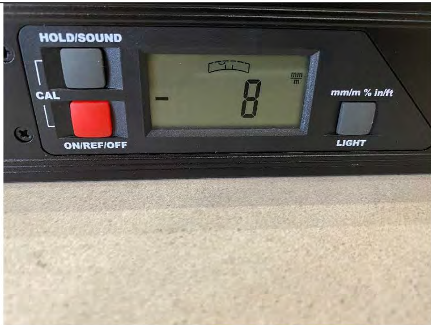
Фото №13. Измерение уровня напольного покрытия в кухне.
