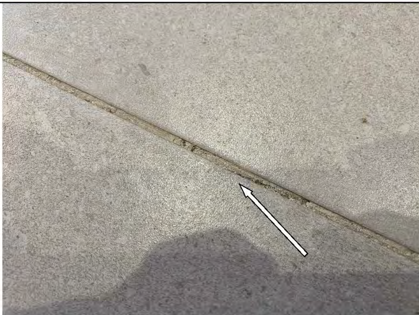
Фото №17. Затирка напольной плитки в кухне выполнена с нарушениями (неполное заполнение шовного пространства затирочным составом).
