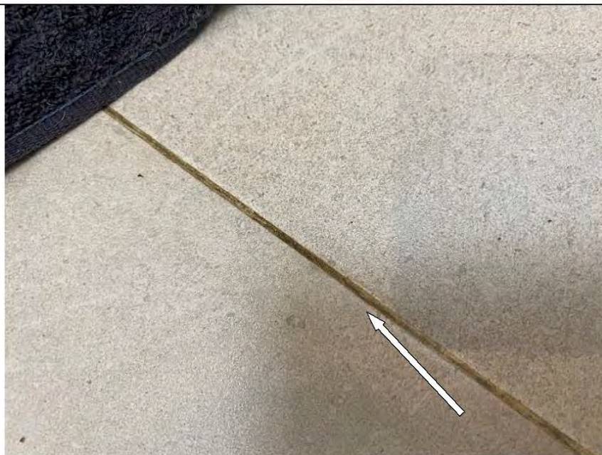
Фото №15. Затирка напольной плитки в коридоре выполнена с нарушениями (неполное заполнение шовного пространства затирочным составом).
