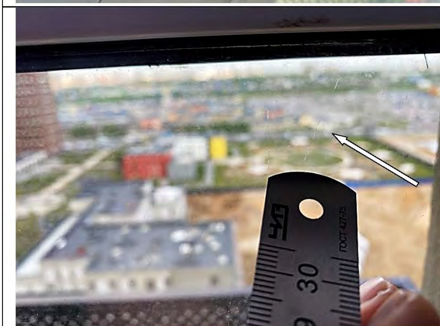
Фото №33. На стеклопакете оконного блока ПВХ в кухне имеется дефект (царапина).
