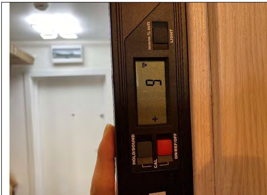
Фото №25. Отклонение коробки от плоскостности дверного блока в спальне.
