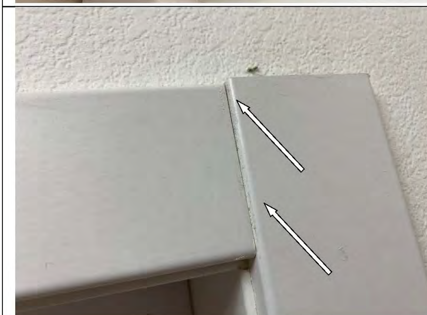
Фото №21. Элементы (наличник) входного дверного блока соединены не надежно.
