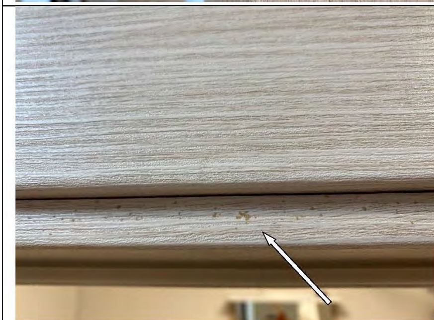
Фото №24. Коробка деревянного дверного блока имеет дефекты (загрязнение монтажной пеной) в ванной комнате.
