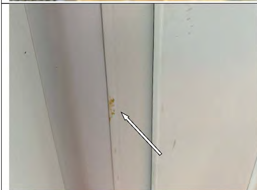
Фото №30. Профиль ПВХ оконного блока в кухне имеет дефекты (загрязнения).
