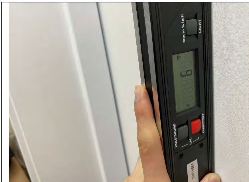
Фото №22. Отклонение полотна от плоскостности входного дверного блока равно 6 мм.
