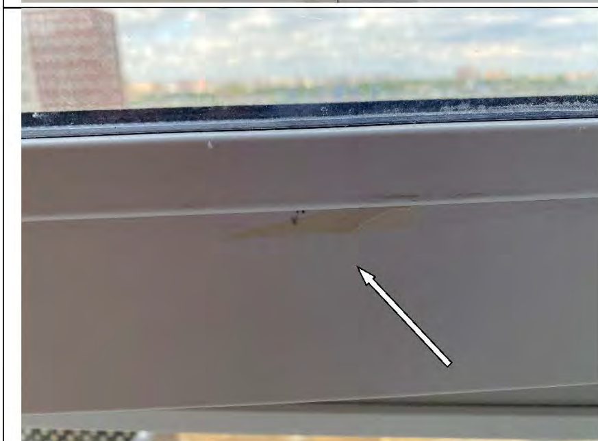
Фото №29. Профиль ПВХ оконного блока в спальне имеет дефекты (загрязнения).
