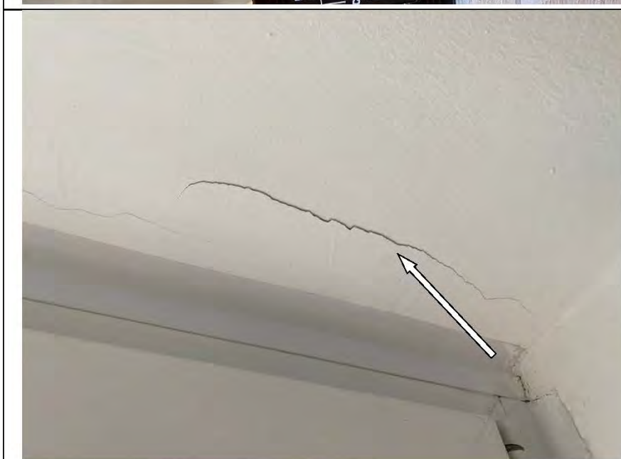
Фото №27. Окрашенные откосы оконного блока ПВХ в спальне выполнены с дефектами (трещины).
