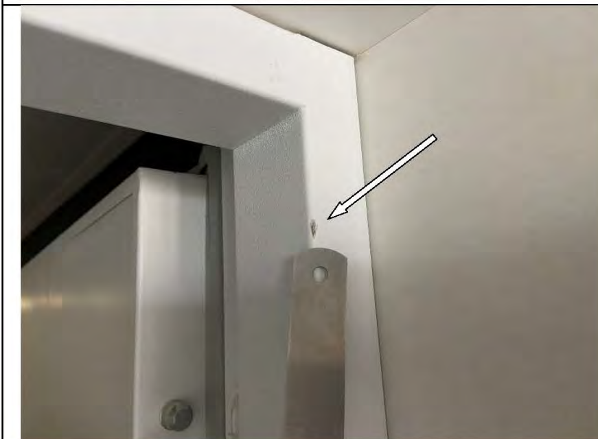
Фото №11. Скол на коробке входного дверного блока в коридоре в квартире.
