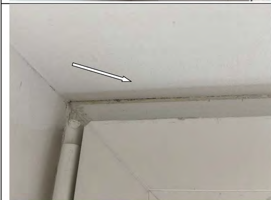
Фото №24. Неровности, выбоины на откосах оконного блока ПВХ в кабинете в квартире.
