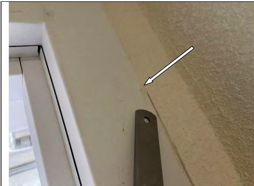
Фото №7. Загрязнения на наличнике входного дверного блока в коридоре в квартире.
