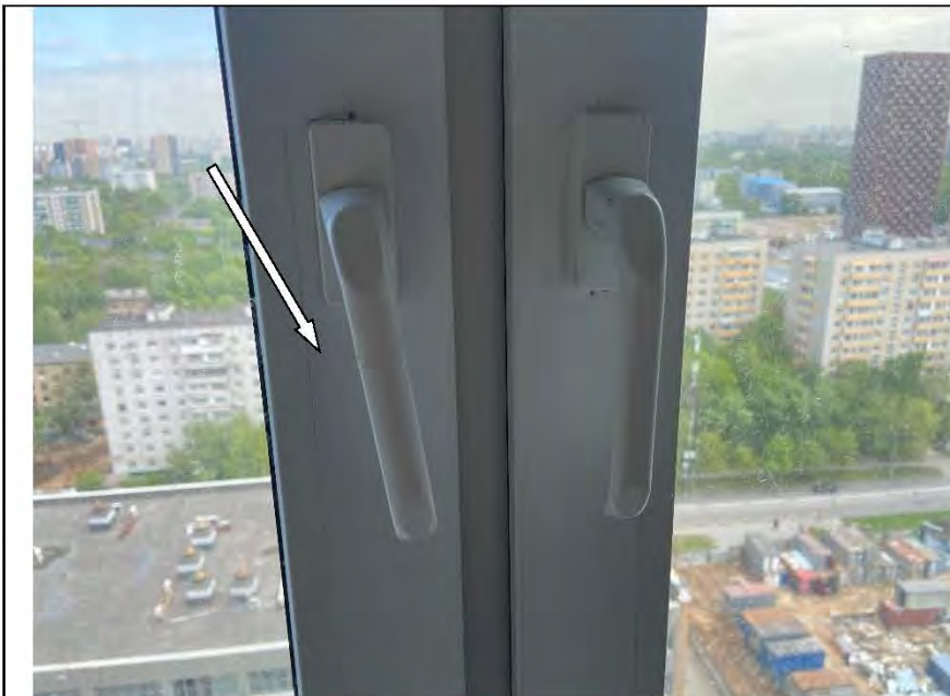
Фото №43. Не отрегулирована фурнитура оконного блока ПВХ в спальне в квартире.
