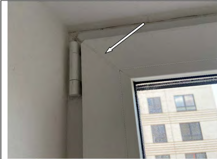
Фото №13. Загрязнения на профиле оконного блока ПВХ в кухне в квартире.
