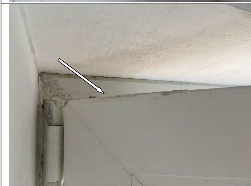
Фото №18. Загрязнения на профиле оконного блока ПВХ в кабинете в квартире.
