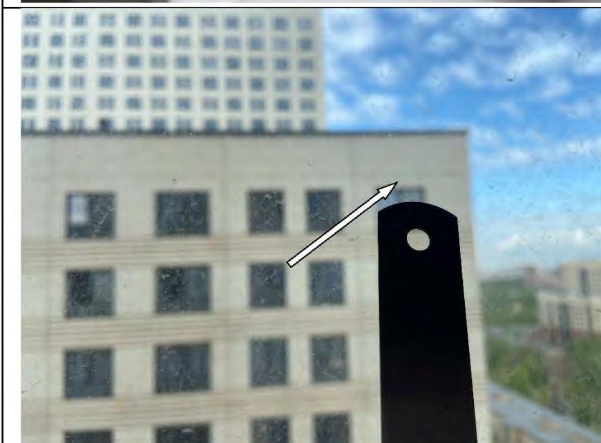
Фото №26. Царапины на стеклопакете оконного блока ПВХ в кухне в квартире.
