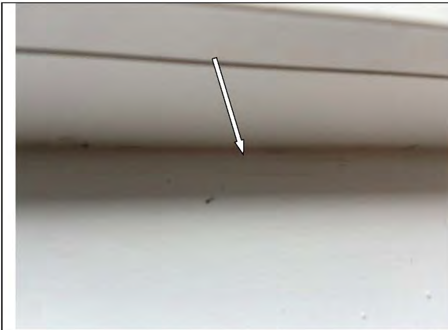
Фото №34. Загрязнения на лицевой стороне подоконной доски в кухне в квартире.
