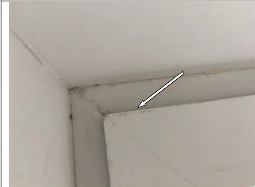
Фото №14. Загрязнения на профиле оконного блока ПВХ в кухне в квартире.
