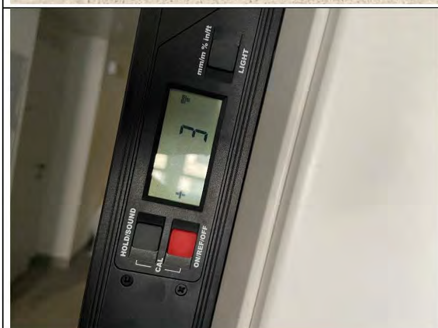
Фото №57. Отклонения входного дверного блока в коридоре в квартире.
