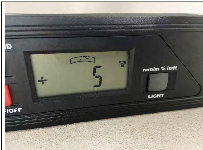
Фото №55. Отклонения напольного покрытия в спальне в квартире.
