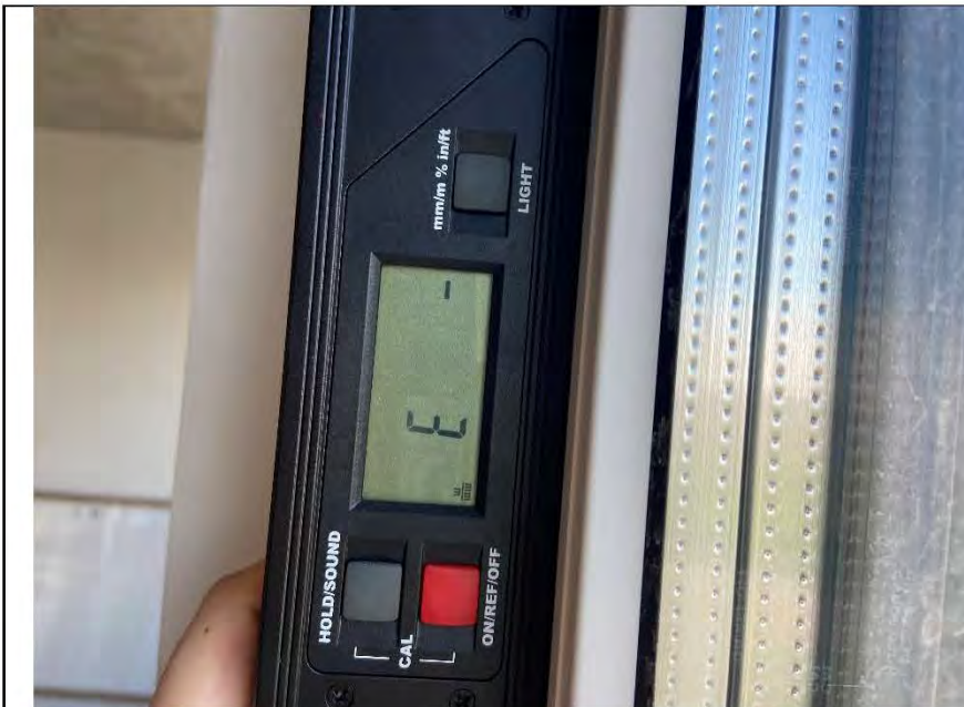
Фото №46. Отклонения оконного блока ПВХ по уровню вертикальности в кухне в квартире.
