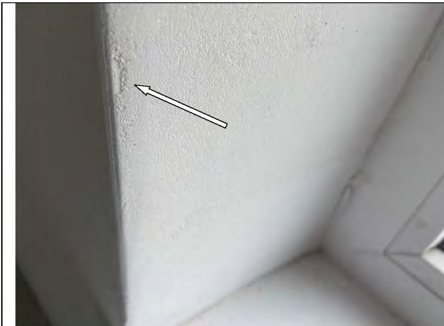
Фото №25. Неровности, выбоины на откосах оконного блока ПВХ в спальне в квартире.
