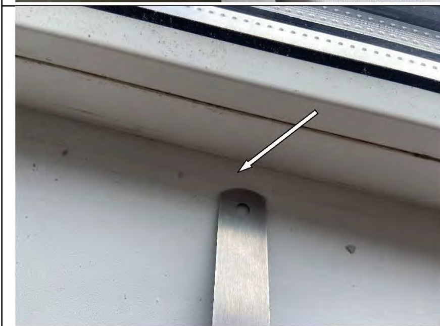
Фото №36. Загрязнения на лицевой стороне подоконной доски в кабинете в квартире.
