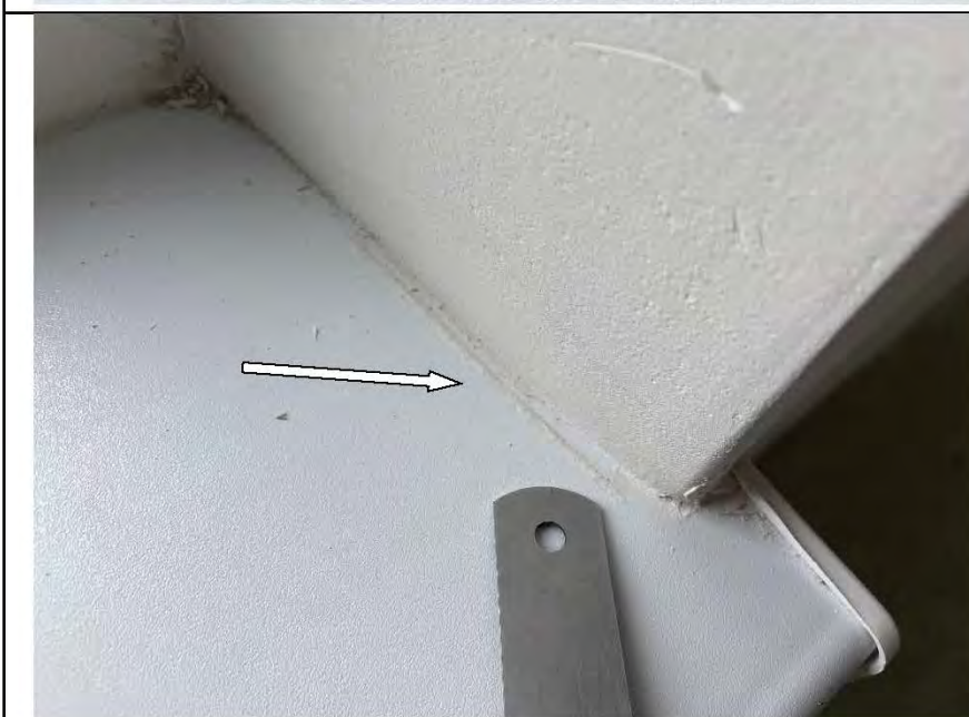
Фото №33. Загрязнения на лицевой стороне подоконной доски в кухне в квартире.
