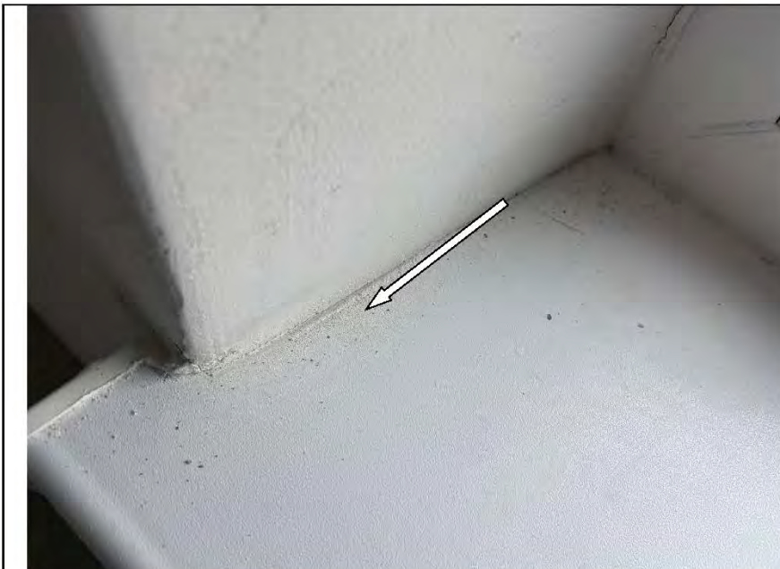
Фото №37. Загрязнения на лицевой стороне подоконной доски в спальне в квартире.
