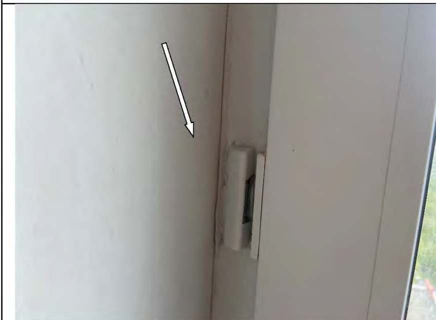
Фото №23. Неровности, выбоины на откосах оконного блока ПВХ в кабинете в квартире.
