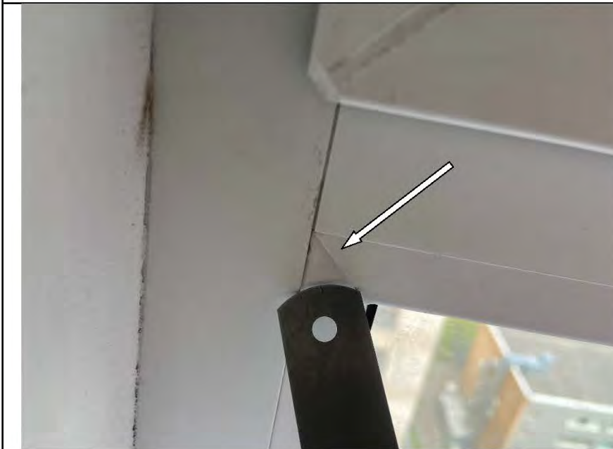
Фото №15. Дефект на профиле оконного блока ПВХ в кухне в квартире.
