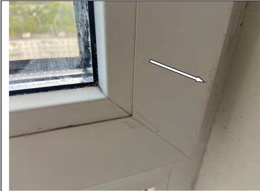
Фото №19. Загрязнения на профиле оконного блока ПВХ в спальне в квартире.
