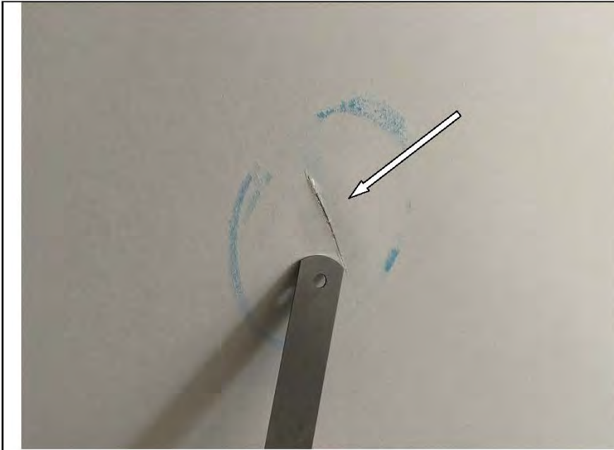
Фото №10. Царапина на полотне входного дверного блока в коридоре в квартире.
