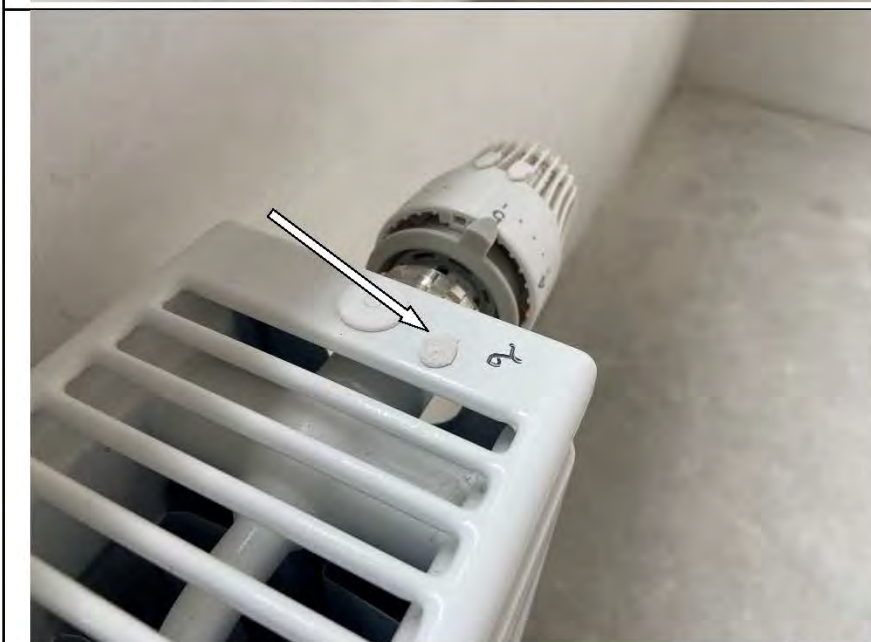
Фото №39. Загрязнения на металлическом кожухе отопительного прибора в кухне в квартире.
