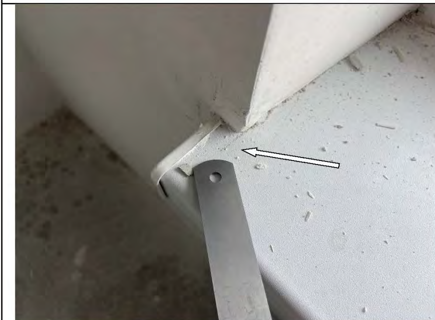
Фото №35. Загрязнения на лицевой стороне подоконной доски в кабинете в квартире.
