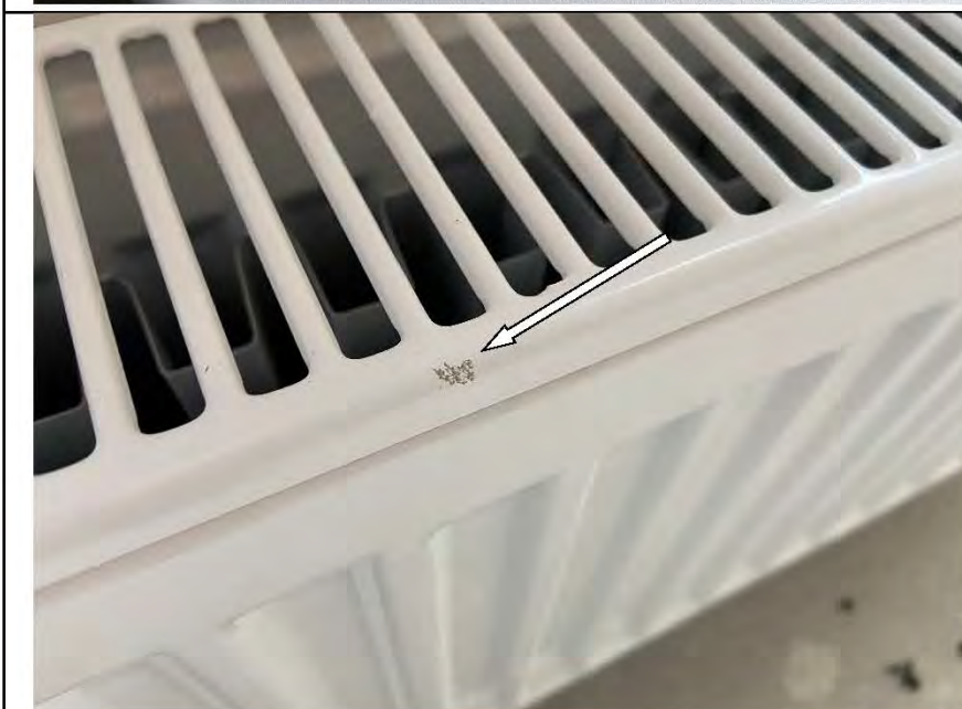
Фото №38. Загрязнения на металлическом кожухе отопительного прибора в кухне в квартире.
