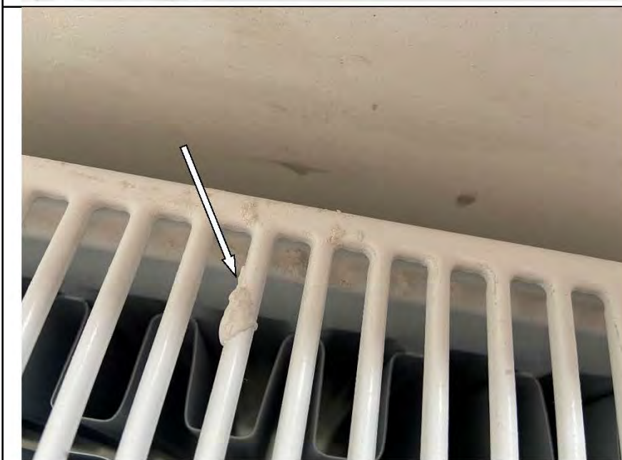
Фото №42. Загрязнения на металлическом кожухе отопительного прибора в спальне в квартире.
