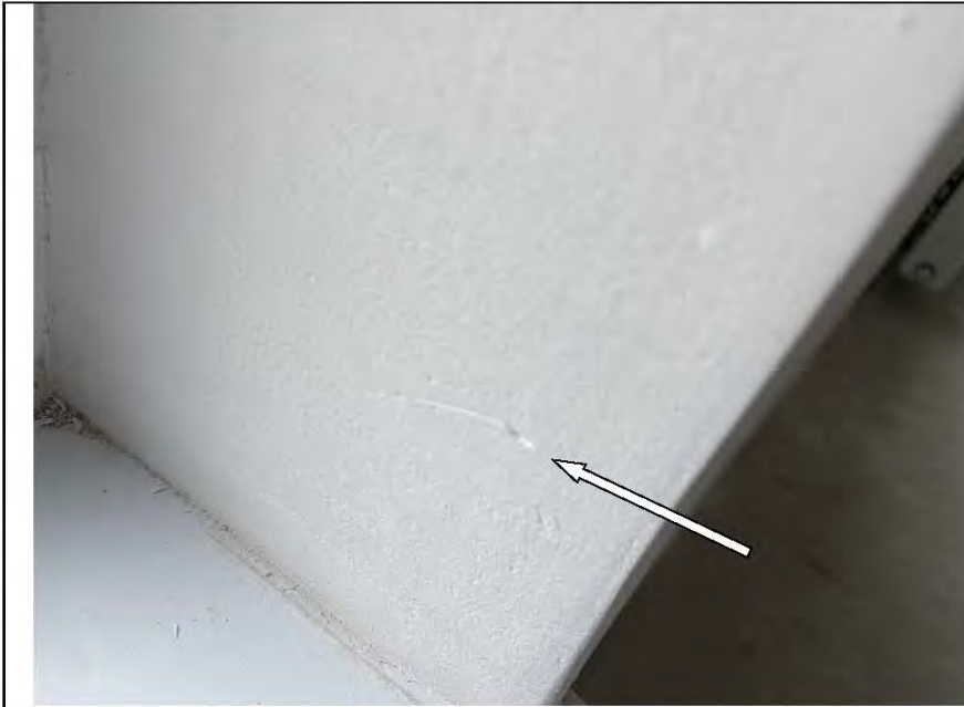
Фото №22. Неровности, выбоины на откосах оконного блока ПВХ в кухне в квартире.
