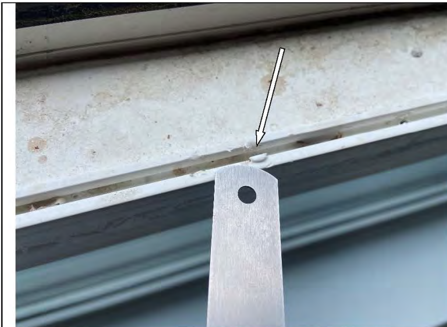
Фото №16. Загрязнения на профиле оконного блока ПВХ в кухне в квартире.
