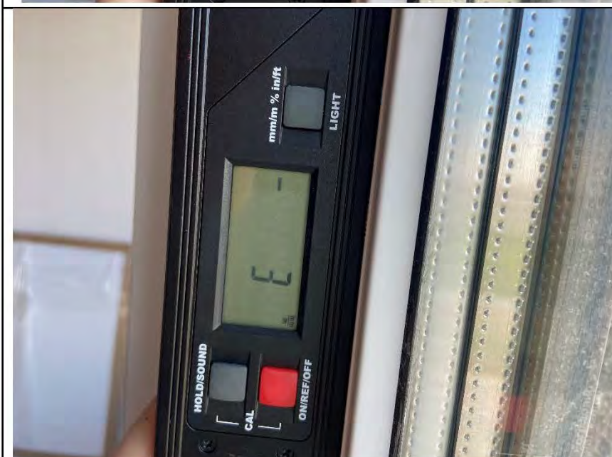
Фото №47. Отклонения оконного блока ПВХ по уровню вертикальности в кухне в квартире.
