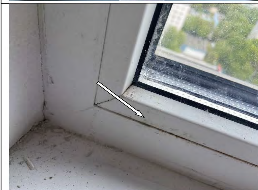
Фото №17. Загрязнения на профиле оконного блока ПВХ в кабинете в квартире.
