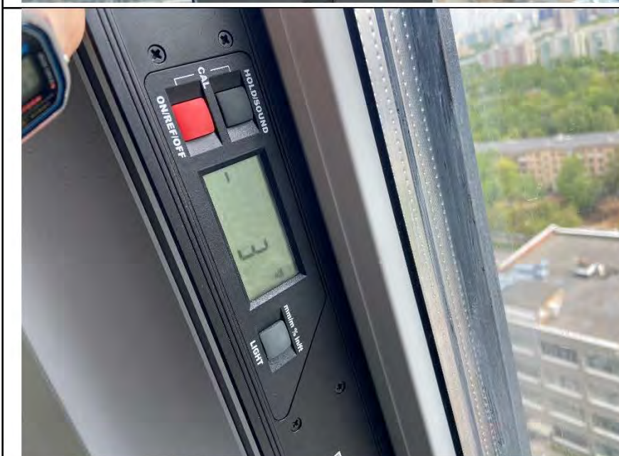
Фото №44. Отклонения оконного блока ПВХ по уровню вертикальности в спальне в квартире.
