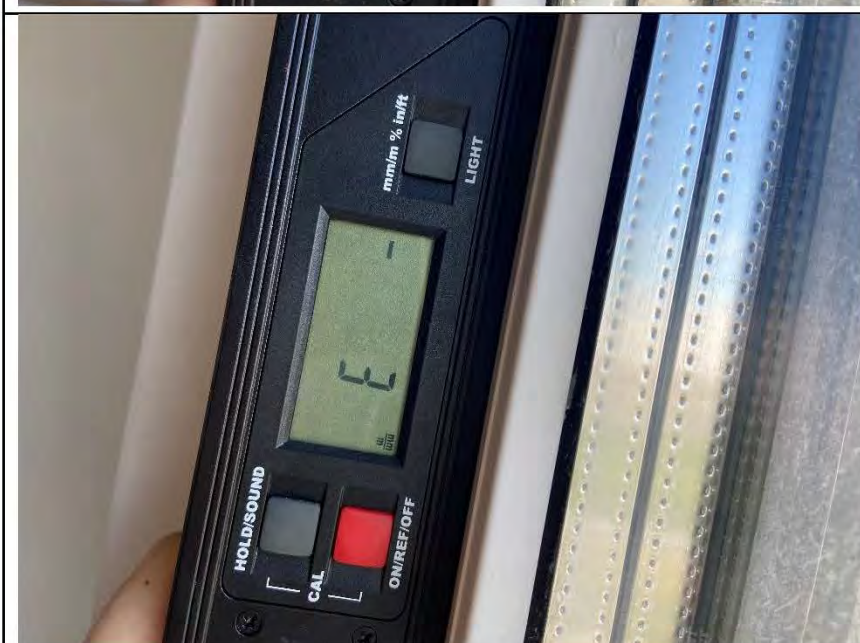
Фото №48. Отклонения оконного блока ПВХ по уровню вертикальности в кухне в квартире.
