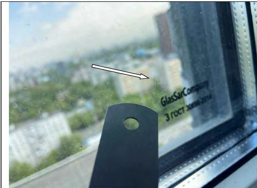
Фото №31. Царапины на стеклопакете оконного блока ПВХ в спальне в квартире.
