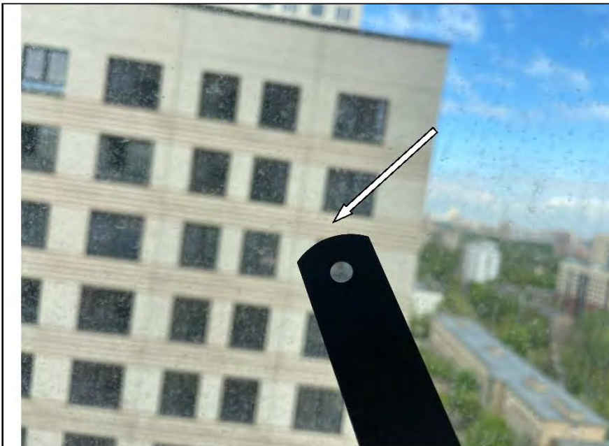
Фото №28. Царапины на стеклопакете оконного блока ПВХ в кухне в квартире.
