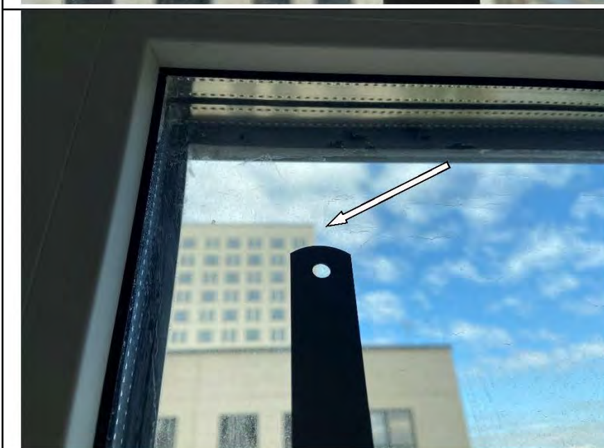
Фото №27. Царапины на стеклопакете оконного блока ПВХ в кухне в квартире.
