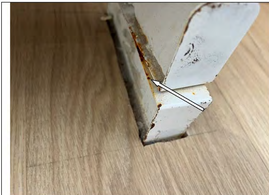
Фото №61. Коррозия на радиаторе в кухне-гостиной.
