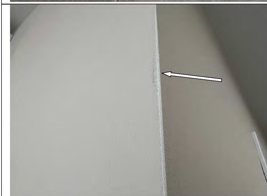
Фото №6. Скол краски на поверхности стен в кухне- гостиной.
