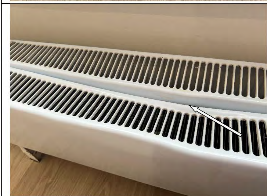
Фото №62. Вмятина кожуха радиатора в кухне-гостиной.
