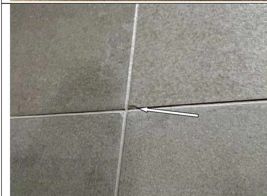
Фото №5. Скол настенной керамической плитки в ванной комнате.
