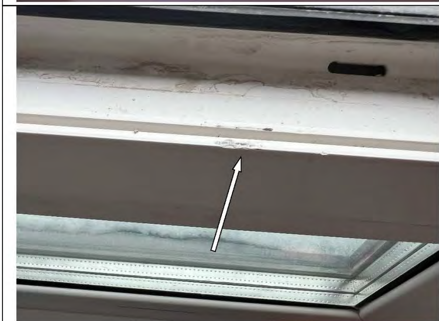
Фото №44. Скол на профиле ПВХ оконного блока в кухне- гостиной.
