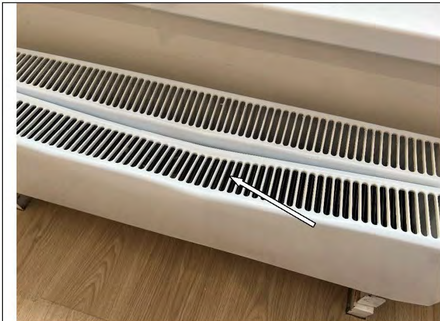
Фото №4. Вмятина кожуха радиатора в кухне-гостиной.
