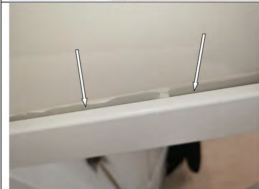
Фото №54. Неплотное прилегание дверного наличника к стене в спальне.
