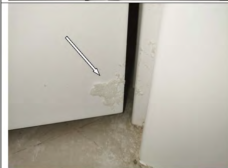
Фото №48. Загрязнение полотна деревянного дверного блока в кухне.
