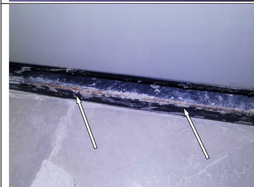
Фото №57. Коррозия на коробе входного дверного блока.
