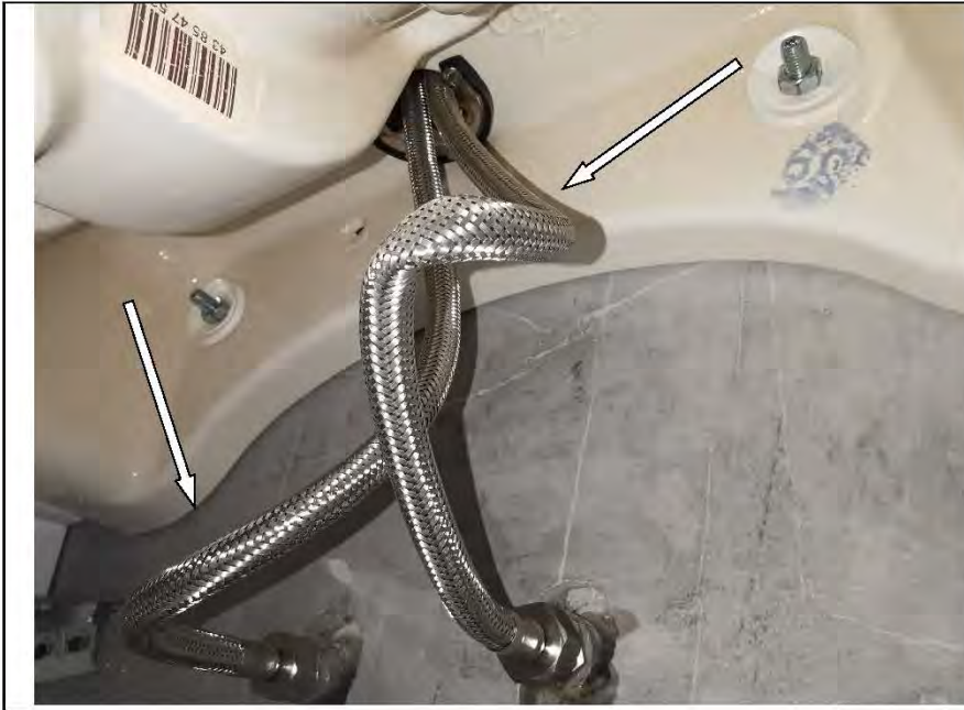
Фото №64. Дефект монтажа гибкой подводки ГВС и ХВС к смесителю раковины в ванной комнате.
