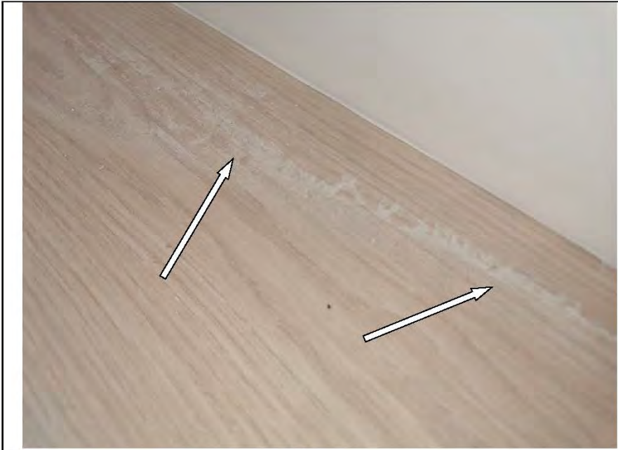
Фото №22. Загрязнение ламината в спальне.
