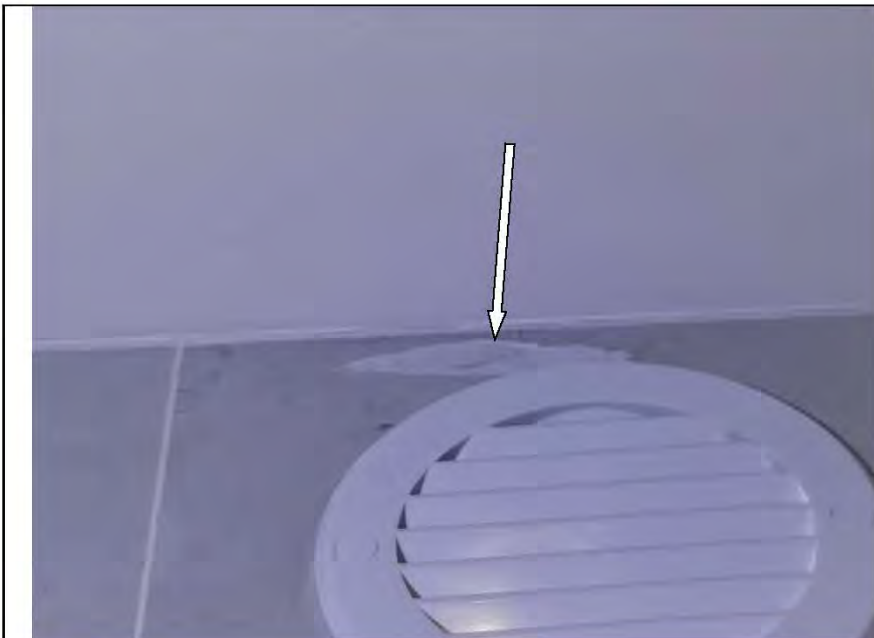
Фото №16. На настенной керамической плитке в ванной комнате имеются дефекты (загрязнения).
