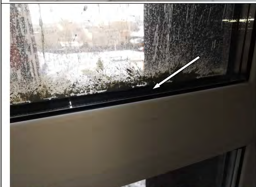
Фото №44. Загрязнение стеклопакета оконного блока ПВХ в спальне.
