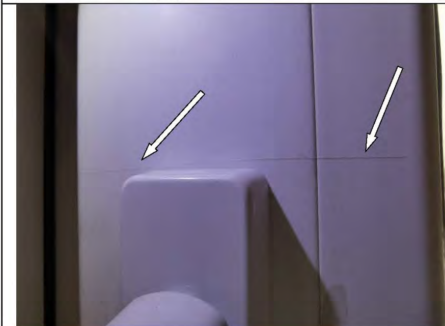
Фото №41. Царапины на профиле ПВХ оконного блока на кухне.
