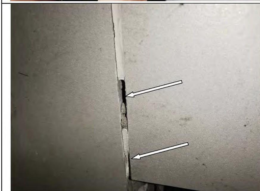
Фото №14. Некачественное заполнение шовного пространства настенной керамической плитки затирочным составом в ванной комнате.
