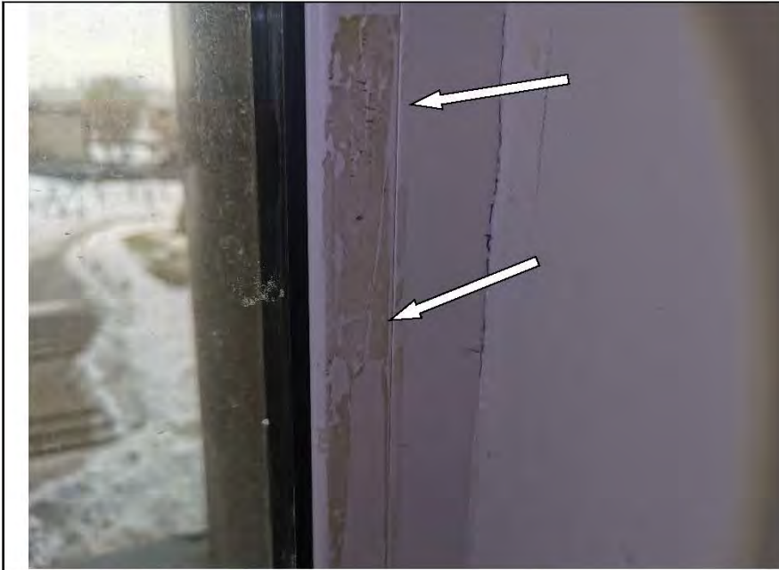
Фото №40. Загрязнение профиля ПВХ оконного блока на кухне.
