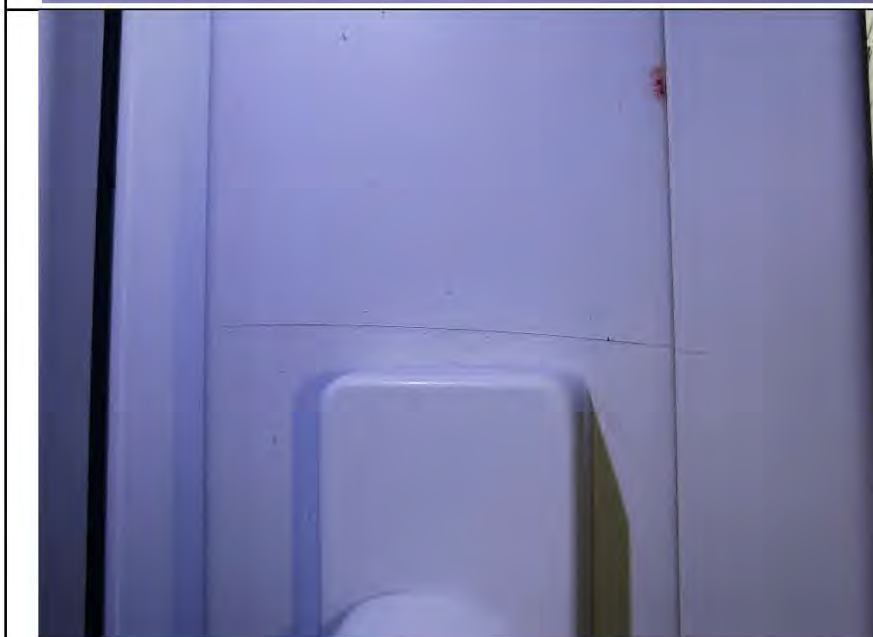
Фото №36. Царапины на профиле ПВХ оконного блока в спальне.
