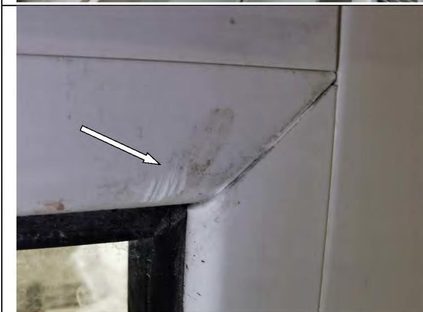
Фото №39. Потертости на профиле ПВХ оконного блока на кухне.
