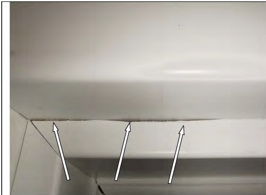
Фото №49. Повреждение короба деревянного дверного блока в спальне.
