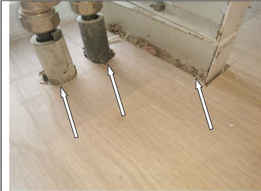
Фото №25. Заделка отверстия для трубопровода отопления в напольном покрытии из ламината выполнена с дефектом в кухне.
