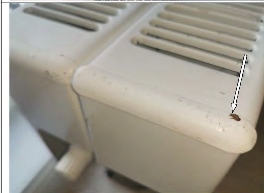
Фото №59. Радиатор в спальне и кухне имеет дефекты (потертости).
