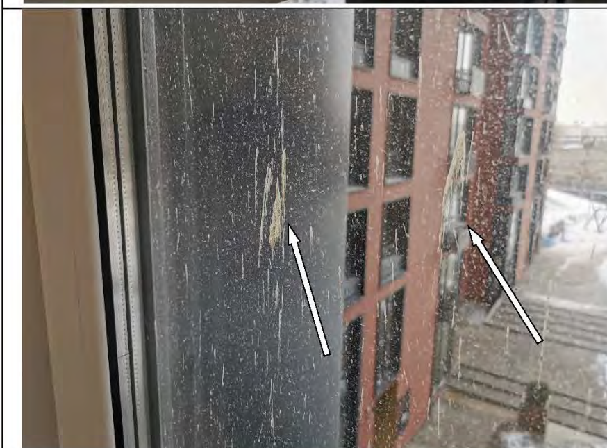
Фото №45. Загрязнение стеклопакета оконного блока ПВХ на кухне.
