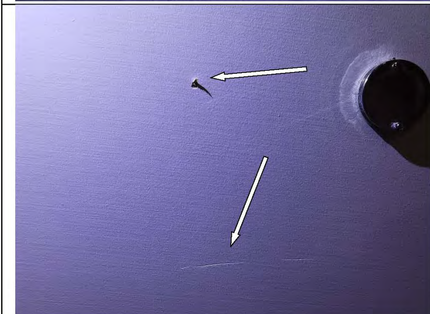
Фото №56. Повреждение полотна входного дверного блока.
