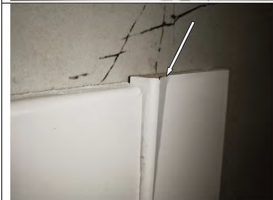
Фото №51. Повреждение наличников деревянного дверного блока в ванной комнате.
