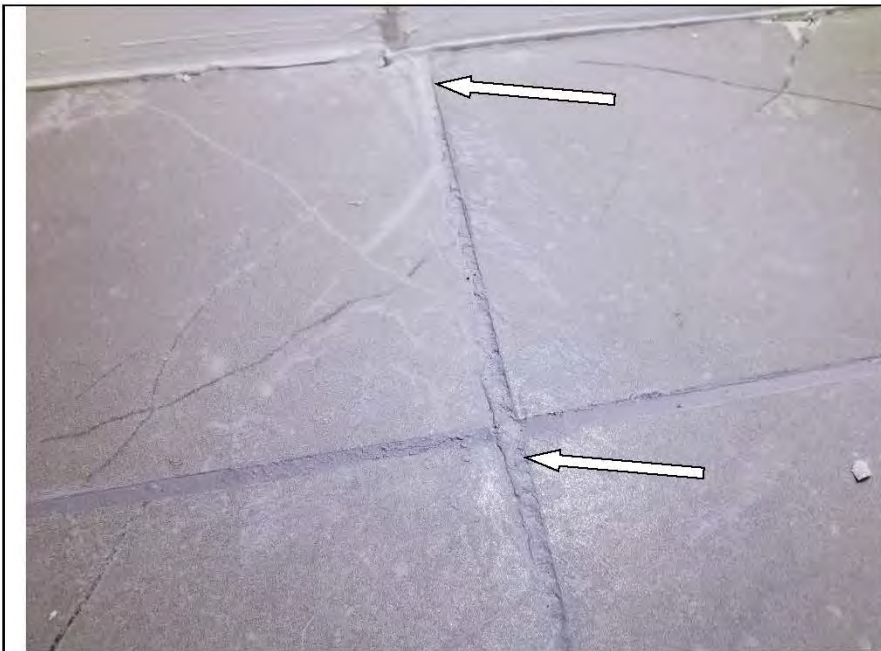
Фото №31. Затирка напольной плитки в кухне выполнена с нарушениями.
