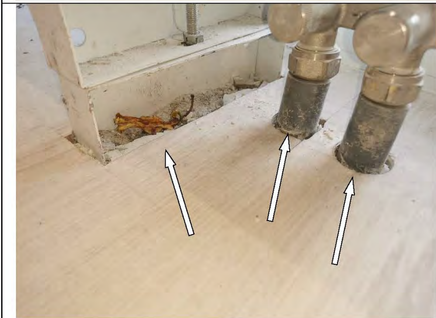
Фото №26. Заделка отверстия для трубопровода отопления в напольном покрытии из ламината выполнена с дефектом в спальне.
