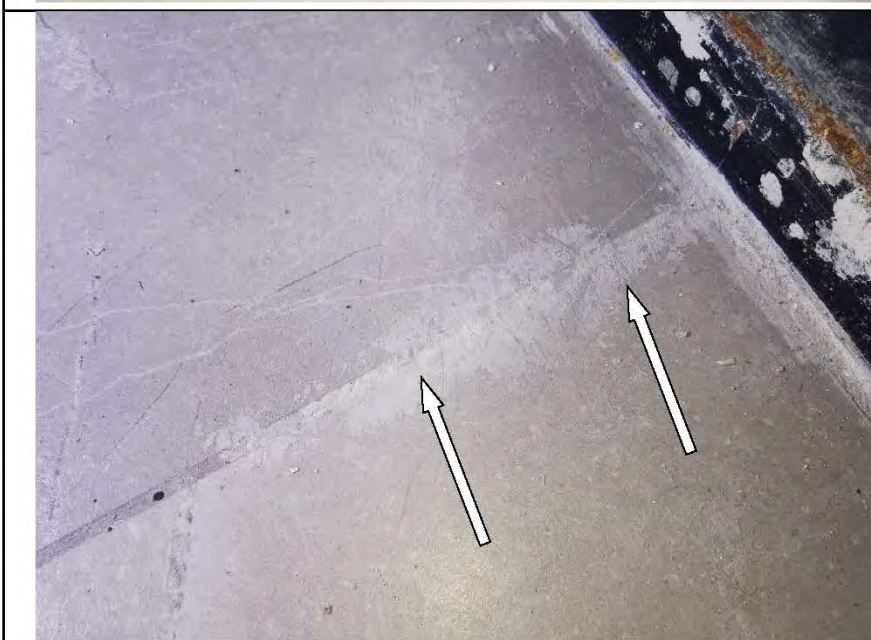
Фото №30. Затирка напольной плитки в коридоре выполнена с нарушениями.
