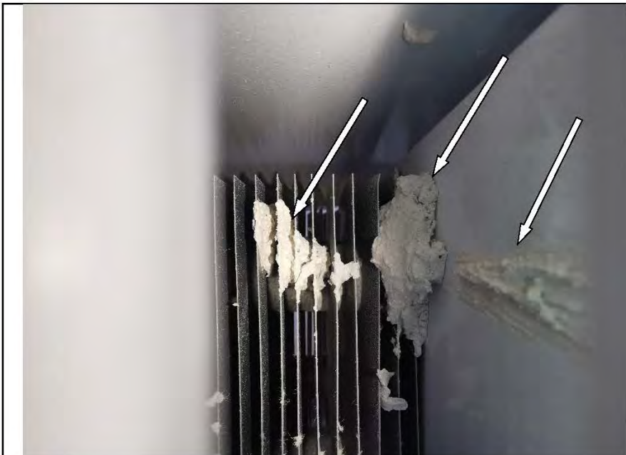
Фото №58. Радиатор в спальне и кухне имеет дефекты (загрязнения).
