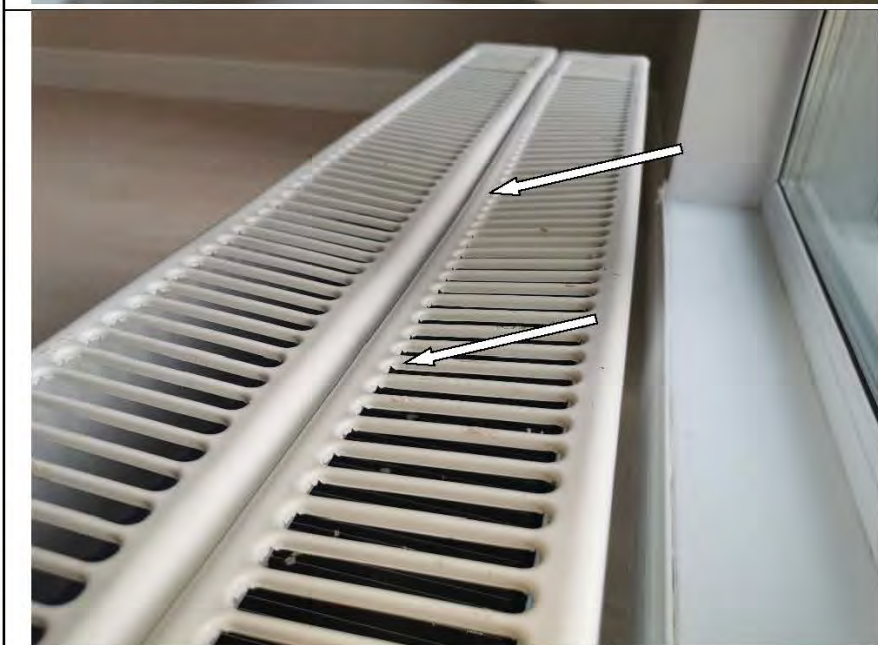
Фото №60. Замытие кожуха радиатора в спальне.
