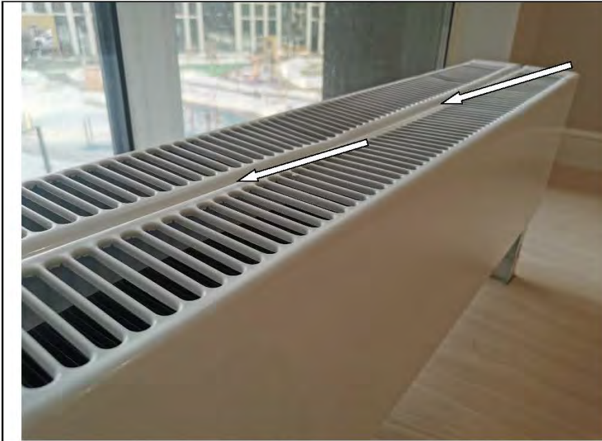
Фото №61. Замятие кожуха радиатора в кухне.
