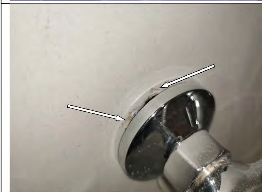
Фото №17. Настенная керамическая плитка в ванной комнате имеет дефекты (механические повреждения).
