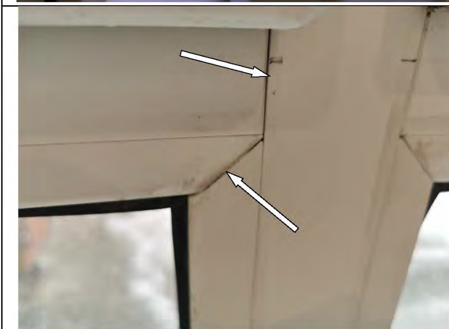
Фото №42. Зазор в месте стыка профилей ПВХ оконного блока на кухне.
