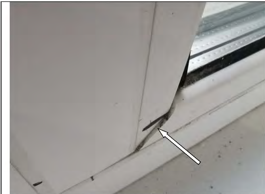
Фото №43. Зазор в месте стыка профилей ПВХ оконного блока на кухне.
