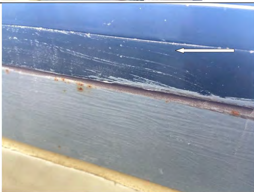
Фото №36. Царапина на профиле алюминиевого оконного блока на лоджии 1 в квартире.
