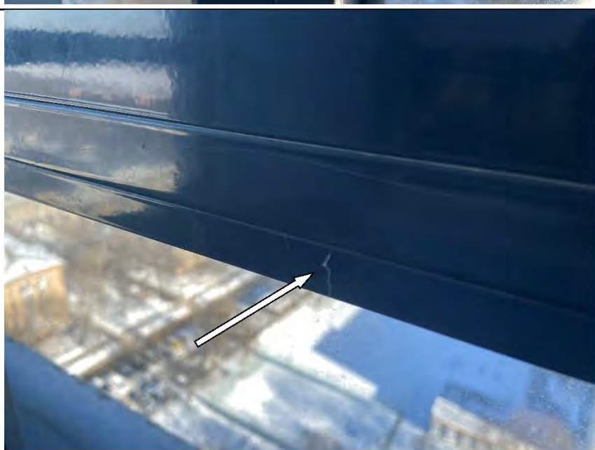
Фото №39. Царапина на профиле алюминиевого оконного блока на лоджии 2 в квартире.
