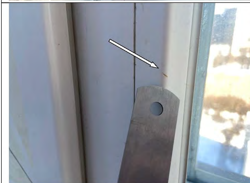
Фото №15. Скол на профиле оконного блока ПВХ в спальне в квартире.
