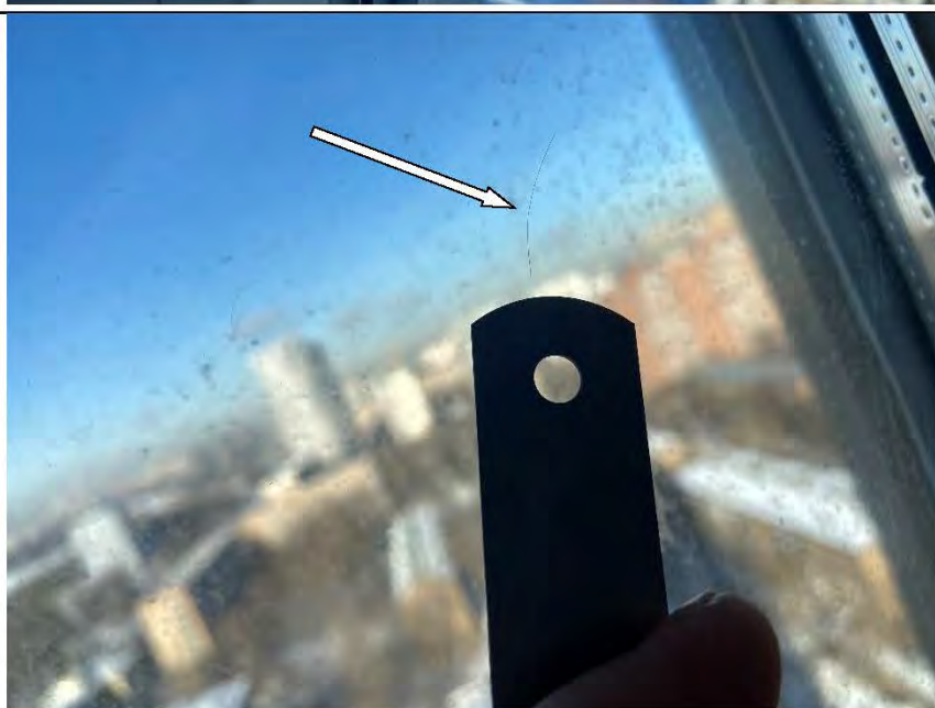
Фото №27. Царапина на стеклопакете оконного блока ПВХ в детской в квартире.
