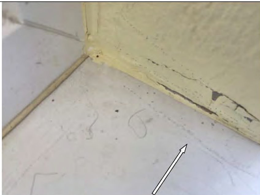
Фото №28. Царапина на лицевой стороне подоконной доски в кухне в квартире.
