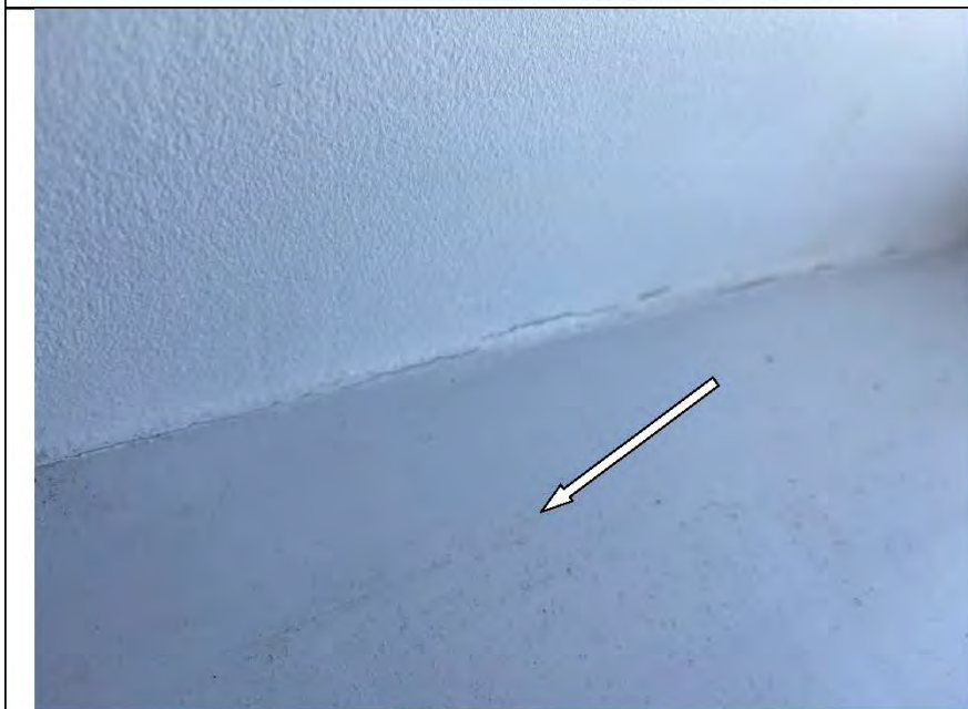
Фото №32. Царапина на лицевой стороне подоконной доски в спальне в квартире.
