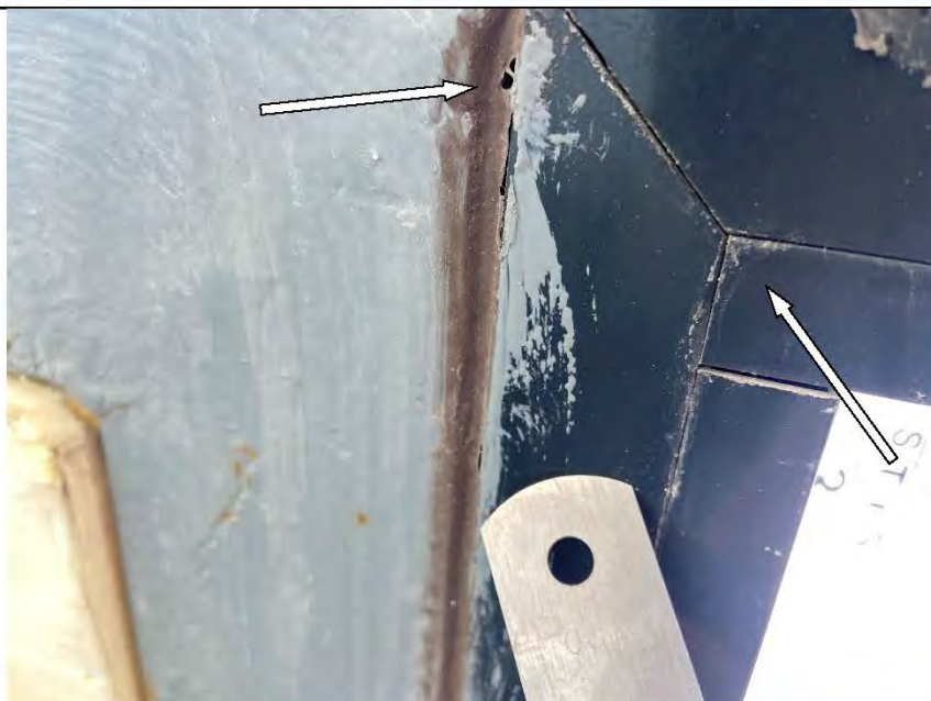
Фото №35. Узел оконного блока на лоджии 2 выполнен с нарушениями, а также царапина на алюминиевом профиле.
