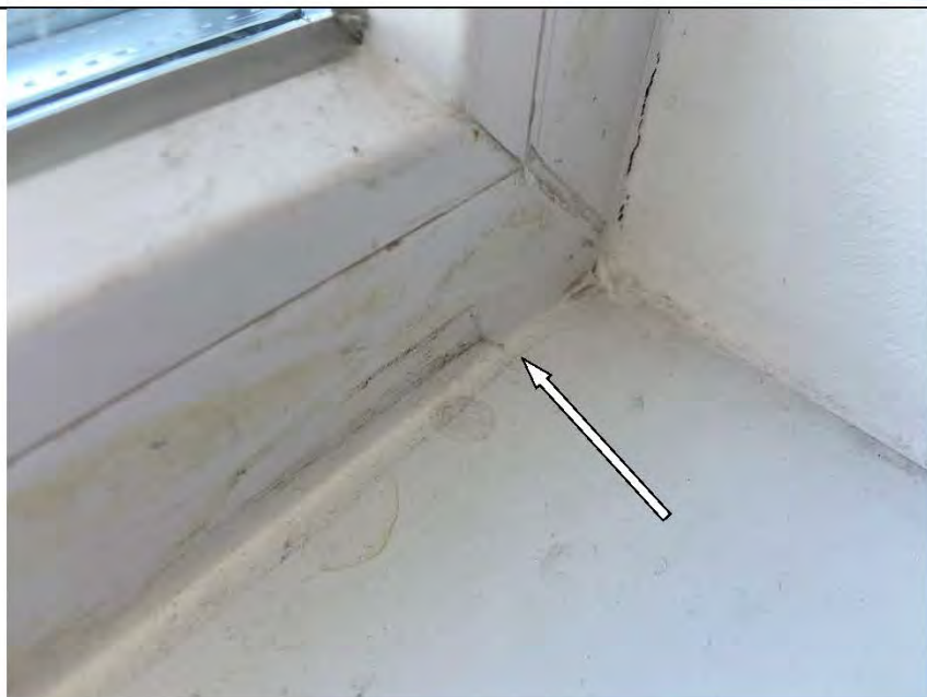
Фото №29. Загрязнения на лицевой стороне подоконной доски в кабинете в квартире.
