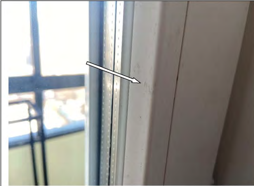
Фото №7. Загрязнения на профиле оконного блока ПВХ в кухне в квартире.
