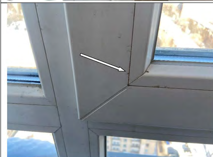
Фото №9. Загрязнения на профиле оконного блока ПВХ в кабинете в квартире.
