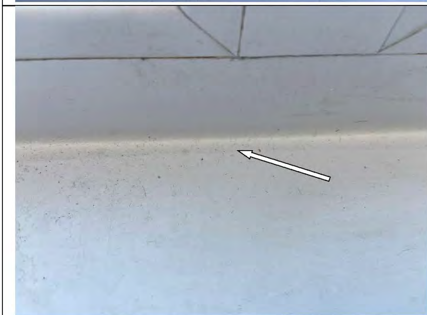
Фото №33. Загрязнения на лицевой стороне подоконной доски в спальне в квартире.
