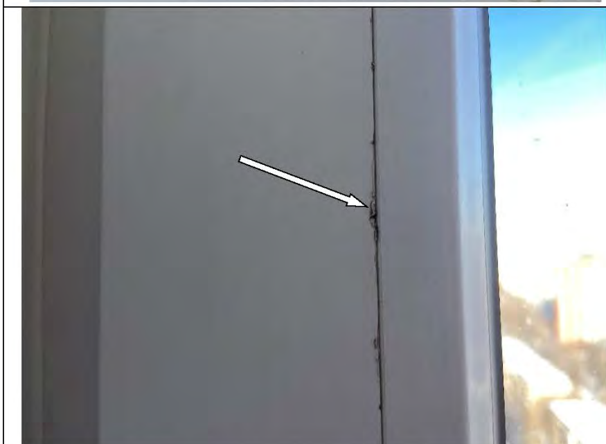
Фото №11. Загрязнения на профиле оконного блока ПВХ в кабинете в квартире.
