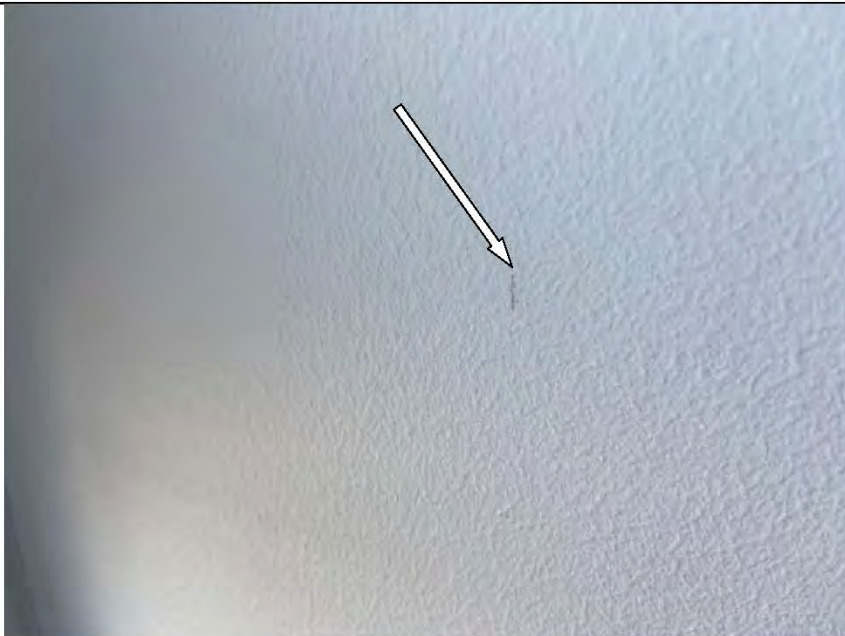
Фото №41. Неровности, сколы, подтеки на окрашенных откосах оконного блока ПВХ в кабинете в квартире.
