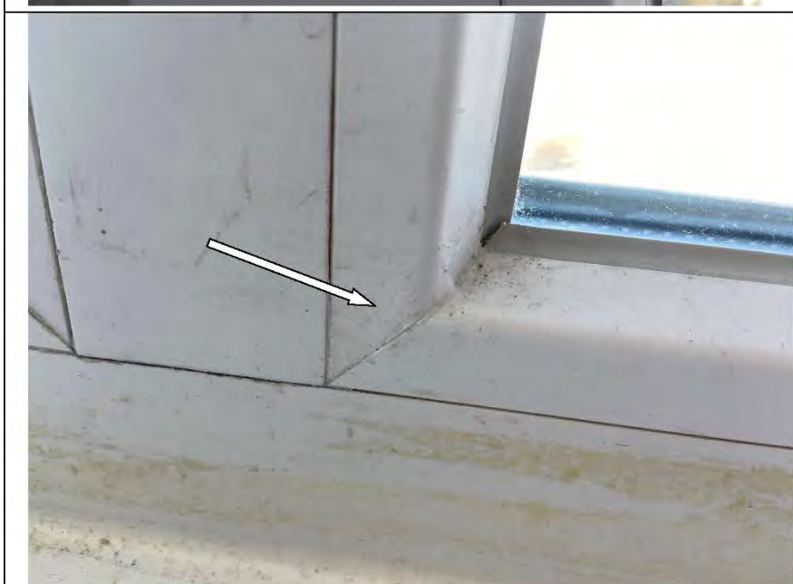
Фото №12. Загрязнения на профиле оконного блока ПВХ в кабинете в квартире.
