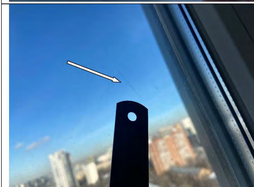
Фото №23. Царапина на стеклопакете оконного блока ПВХ в кабинете в квартире.
