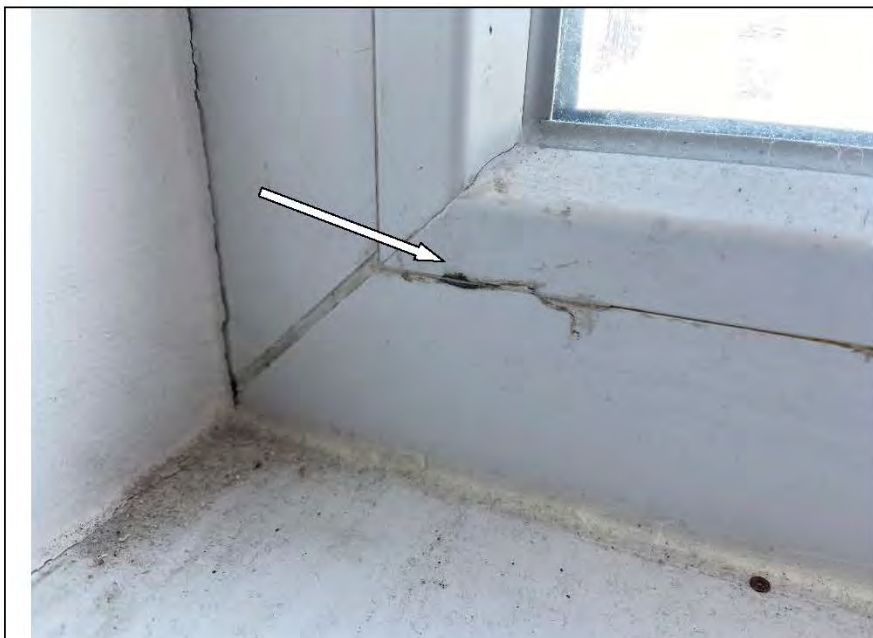
Фото №13. Загрязнения на профиле оконного блока ПВХ в спальне в квартире.
