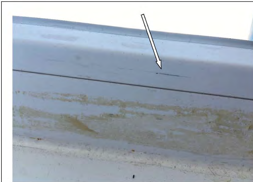
Фото №10. Царапина на профиле оконного блока ПВХ в кабинете в квартире.
