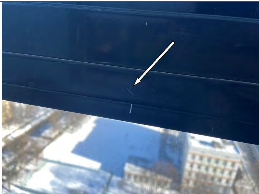
Фото №37. Царапина на профиле алюминиевого оконного блока на лоджии 2 в квартире.
