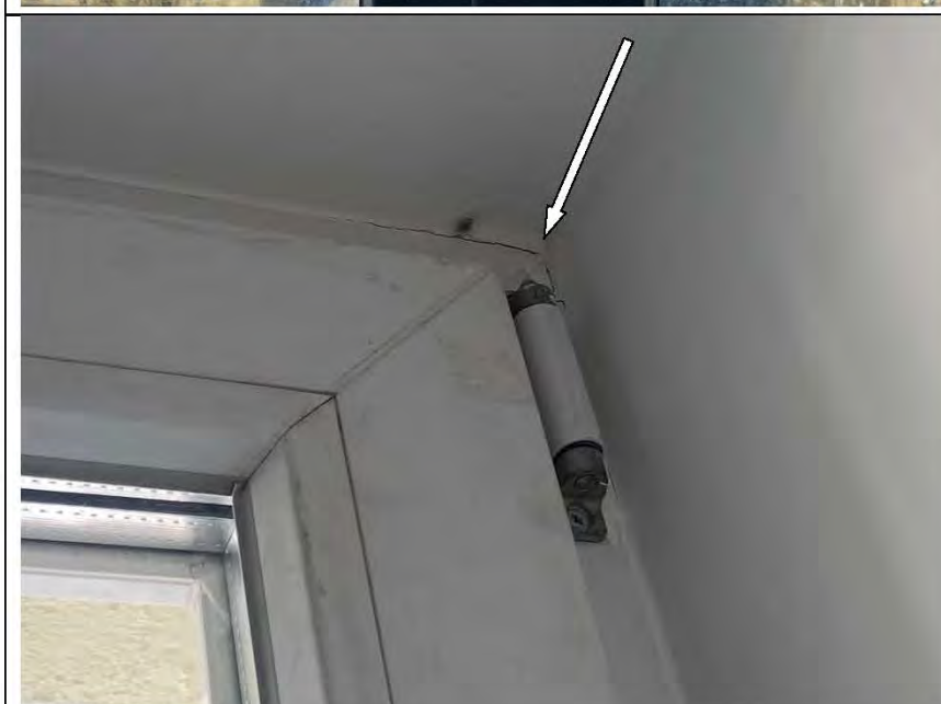
Фото №51. Дефект монтажа оконного блока ПВХ в кухне в квартире.
