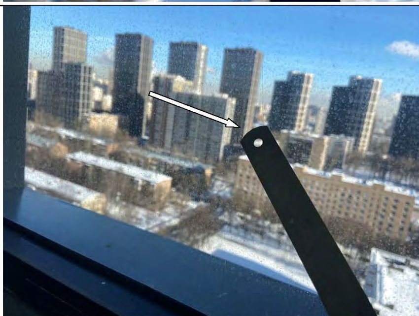
Фото №20. Царапина на стеклопакете оконного блока ПВХ в кабинете в квартире.
