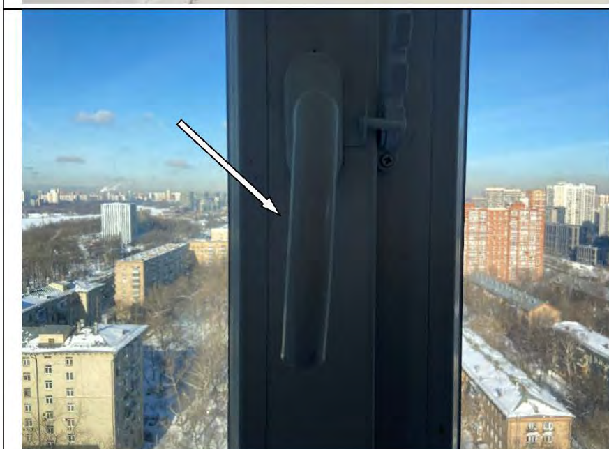
Фото №47. Не отрегулирована фурнитура оконного блока ПВХ в кабинете в квартире.
