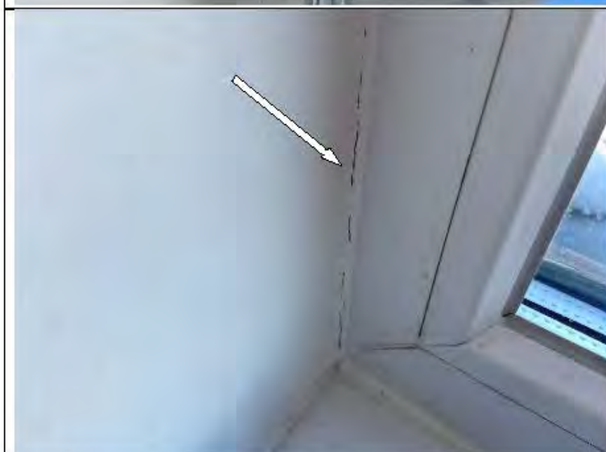
Фото №56. Дефект монтажа оконного блока ПВХ в кабинете в квартире.
