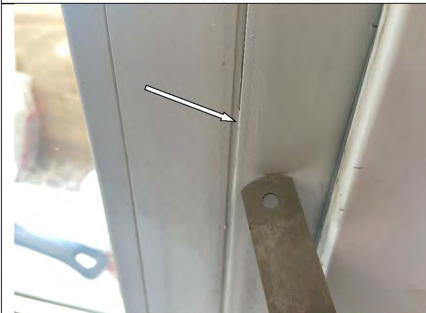
Фото №8. Загрязнения на профиле оконного блока ПВХ в кухне в квартире.
