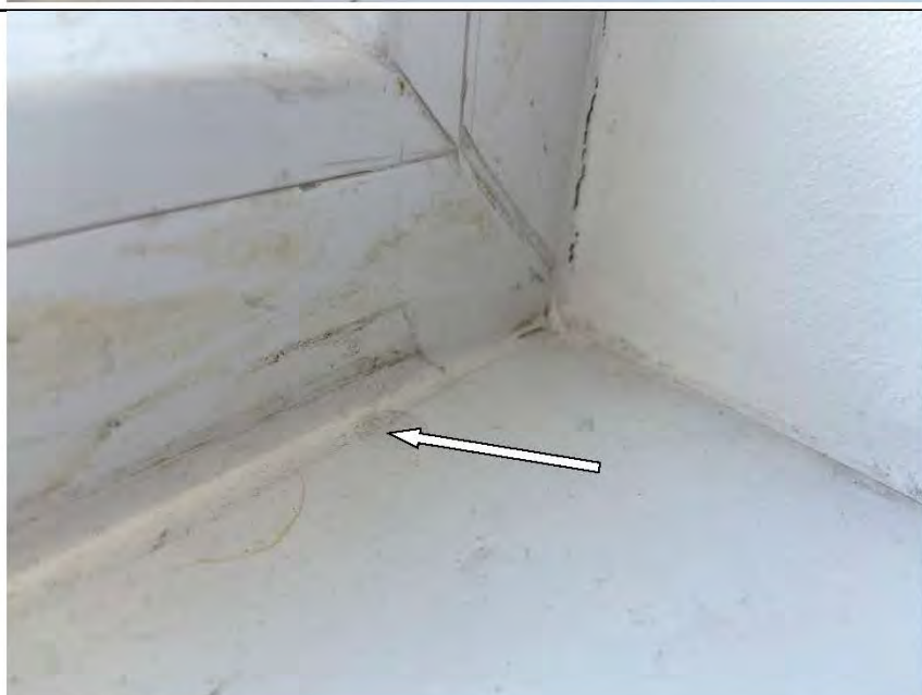
Фото №30. Загрязнения на лицевой стороне подоконной доски в кабинете в квартире.
