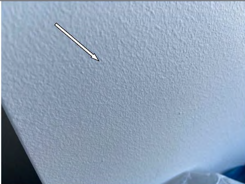
Фото №40. Неровности, сколы, подтеки на окрашенных откосах оконного блока ПВХ в кабинете в квартире.
