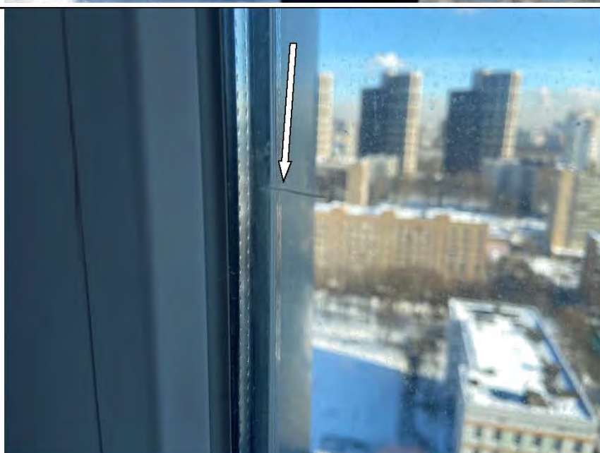
Фото №26. Царапина на стеклопакете оконного блока ПВХ в спальне в квартире.
