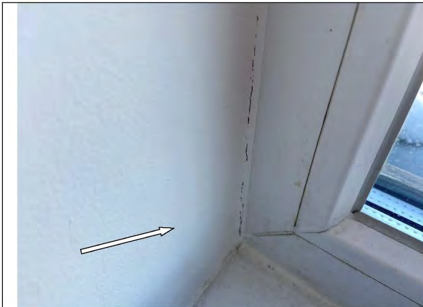
Фото №43. Неровности, сколы, подтеки на окрашенных откосах оконного блока ПВХ в кабинете в квартире.
