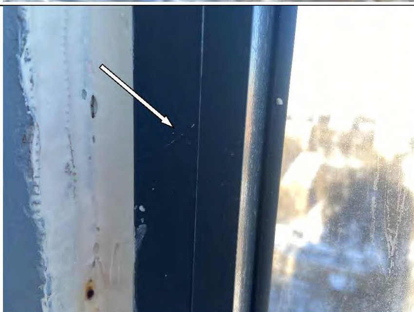
Фото №38. Царапина на профиле алюминиевого оконного блока на лоджии 2 в квартире.
