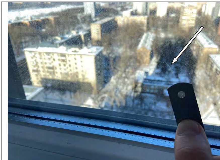
Фото №22. Царапина на стеклопакете оконного блока ПВХ в кабинете в квартире.
