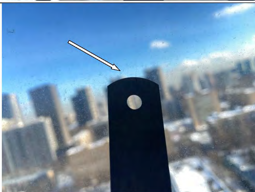
Фото №18. Царапина на стеклопакете алюминиевого оконного блок на лоджии 1 в квартире.
