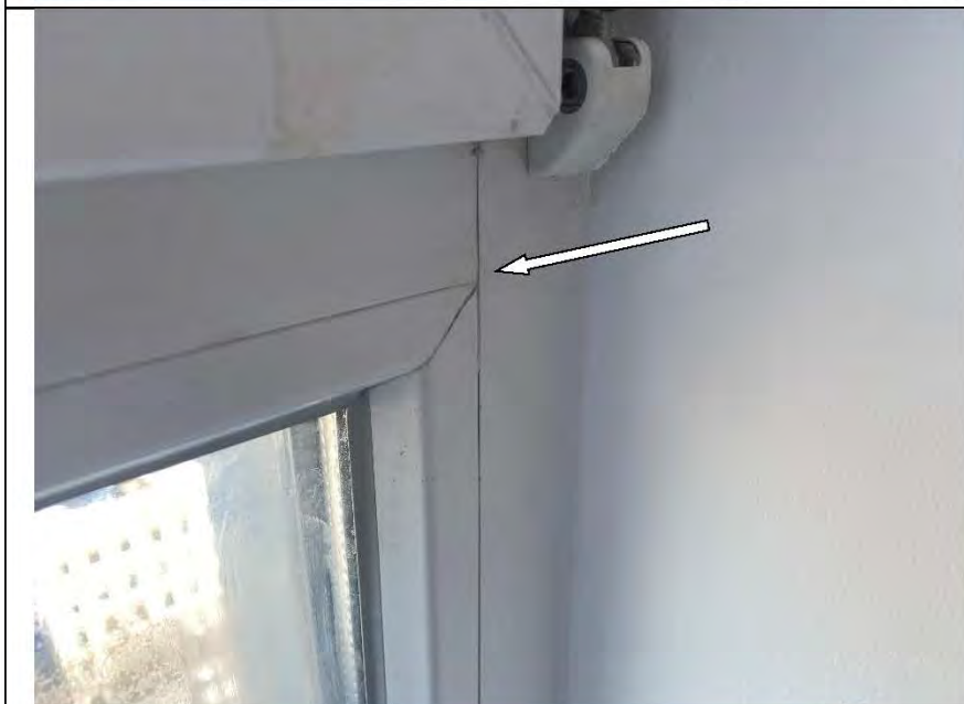
Фото №14. Дефект на профиле оконного блока ПВХ в спальне в квартире.
