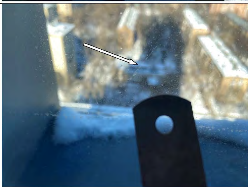
Фото №21. Царапина на стеклопакете оконного блока ПВХ в кабинете в квартире.
