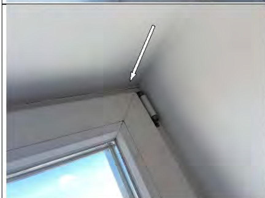
Фото №57. Дефект монтажа оконного блока ПВХ в кабинете в квартире.
