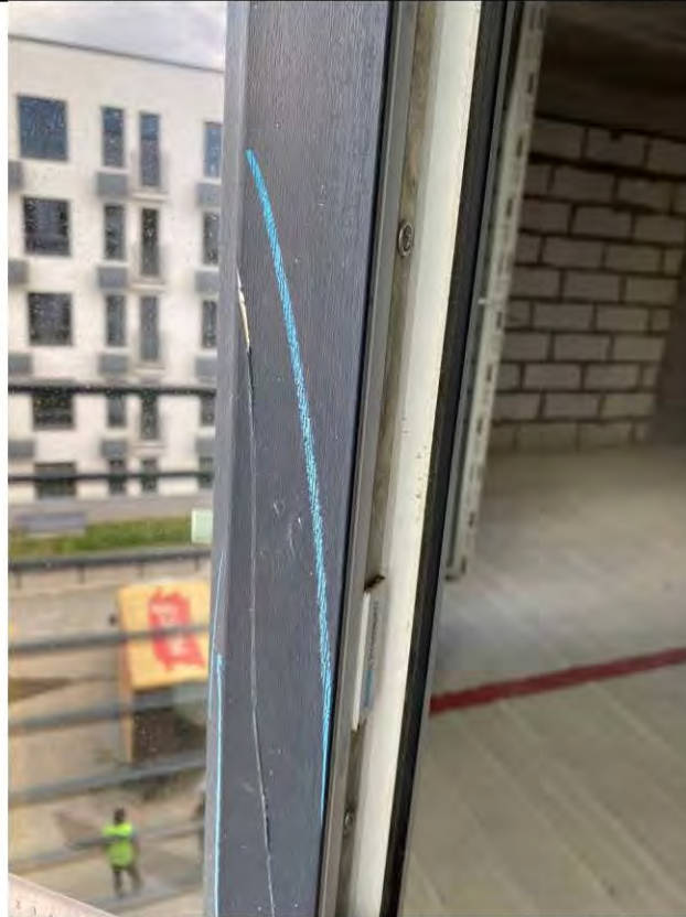
Фото 17-19. Кухня (21,1 кв.м.) 2.1 Наличие царапин и сколов на лицевой поверхности оконного блока
