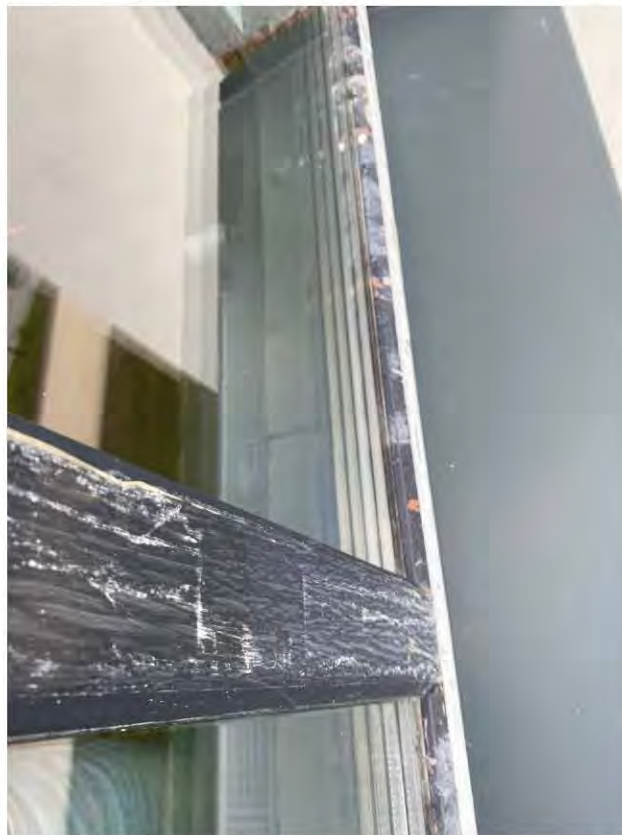
Фото 38. Комната 2 (13,0 кв.м.) 5.4 Отсутствуют капельники на оконном блоке
