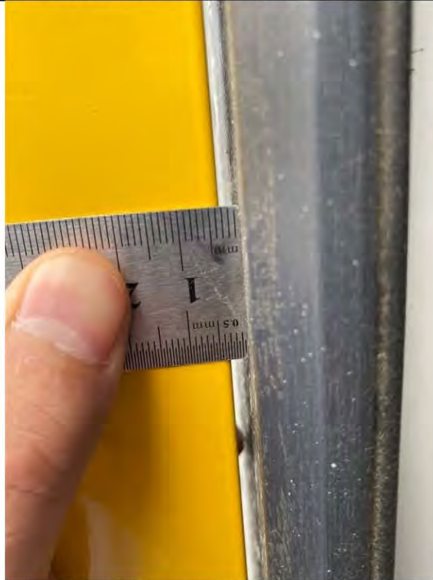
Фото 24. Кухня (21,1 кв.м.) 2.5 Отклонение оконной створки оконного блока от плоскости 3 мм
