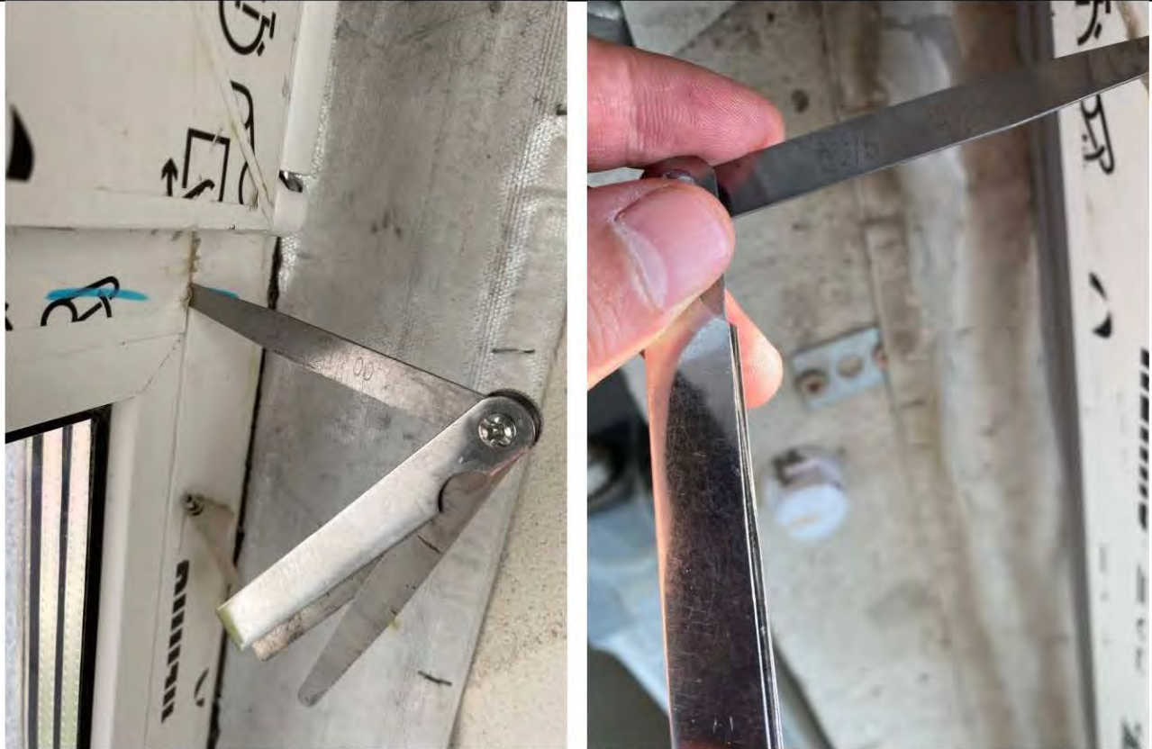
Фото 39, 40. Комната 2 (13,0 кв.м.) 5.5 Зазоры 1 мм, 0,75 мм между элементами оконного блока
