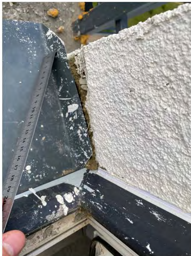
Фото 23. Кухня (21,1 кв.м.) 2.4 Отсутствует герметизация в месте соединения откоса и оконного отлива
