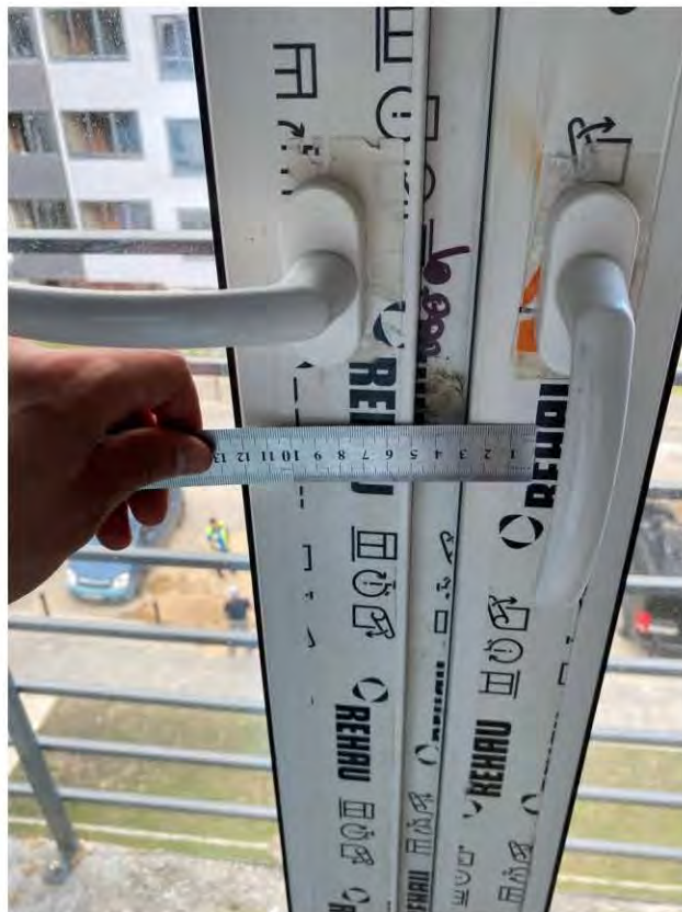
Фото 25. Кухня (21,1 кв.м.) 2.6 При открывании и закрывании обнаружено отклонение в работе одной оконной створки
