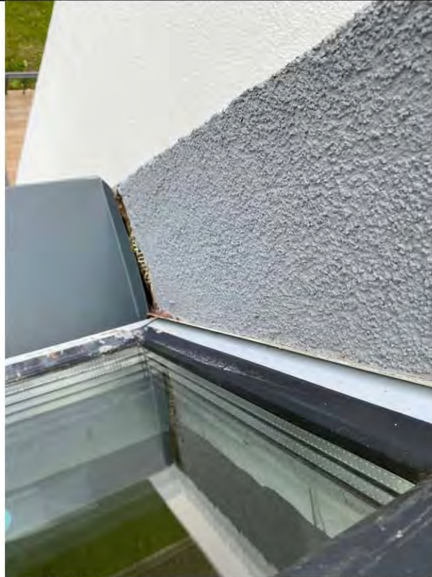
Фото 37. Комната 2 (13,0 кв.м.) 5.3 Отсутствует герметизация в месте соединения откоса и оконного отлива
