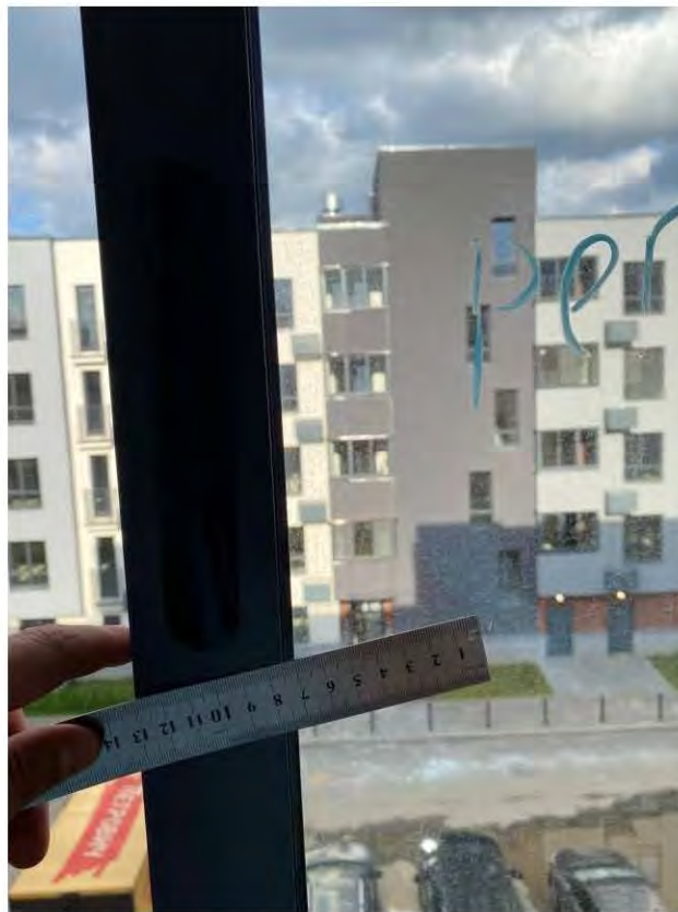
Фото 30. Лоджия (1,9 кв.м.) 4.2 При открывании и закрывании обнаружено отклонение в работе оконной створки
