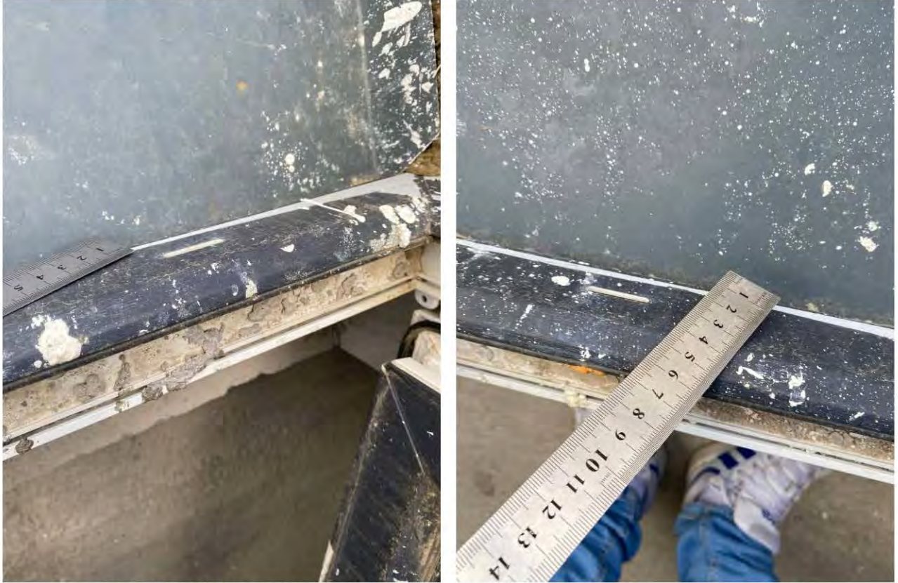
Фото 21, 22. Кухня (21,1 кв.м.) 2.3 Отсутствуют капельники на оконном блоке
