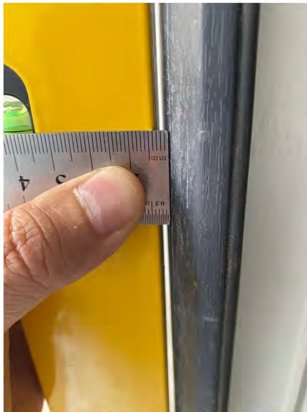
Фото 27. Комната 1 (14,7 кв.м.) 3.2 Отклонение оконного блока от плоскости 3 мм
