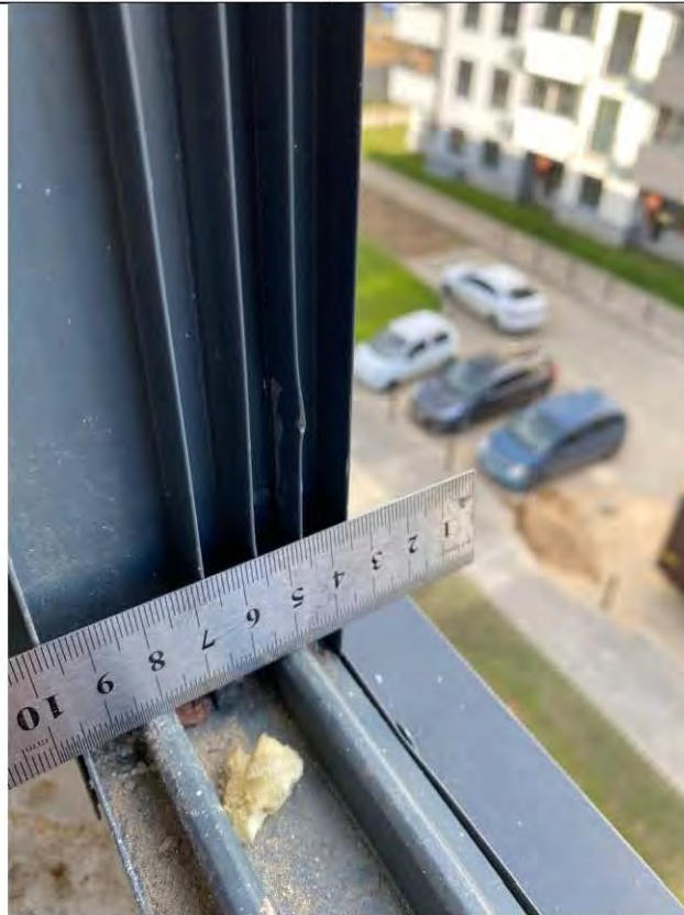
Фото 31. Лоджия (1,9 кв.м.) 4.3 Механическое повреждение на профиле витражной конструкции
