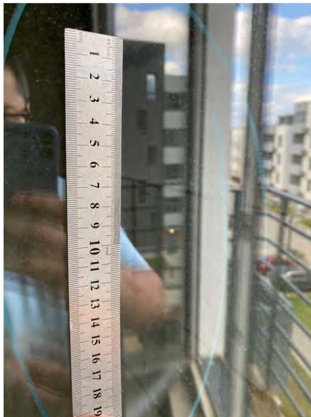
Фото 20. Кухня (21,1 кв.м.) 2.2 Наличие царапины на стеклопакетах
