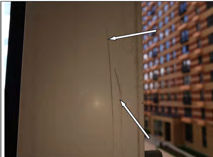
Фото №49. Царапины на профиле ПВХ оконного блока в кухне.
