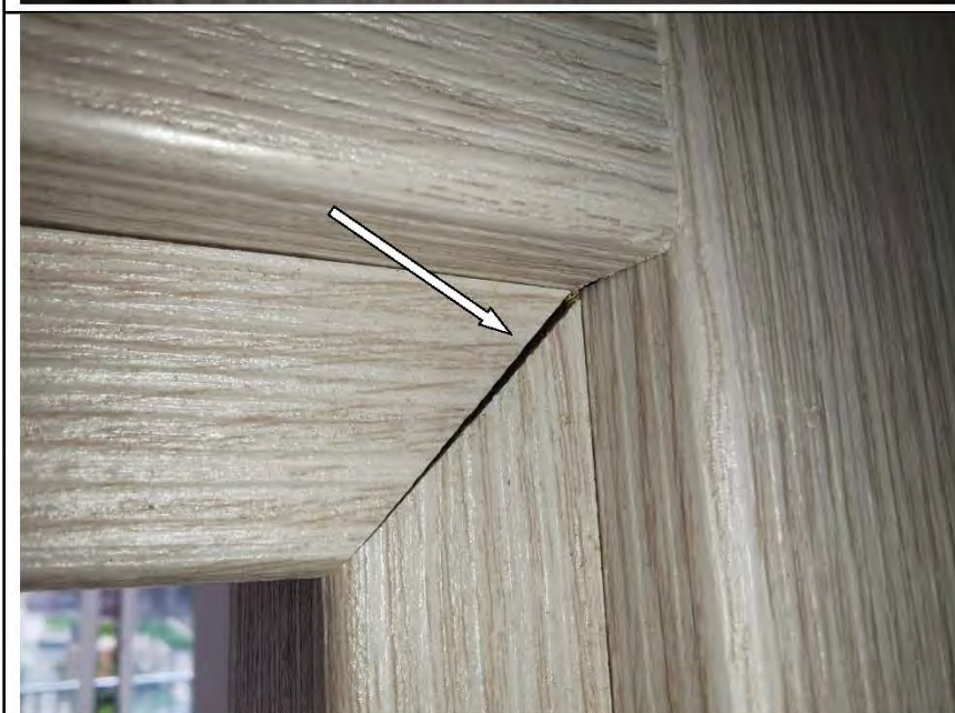
Фото №65. Ненадежное соединение элементов короба деревянного дверного блока в спальне.
