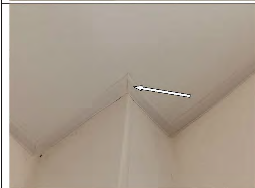
Фото №38. Дефект монтажа декоративного молдинга крепления натяжного потолка в кухне.
