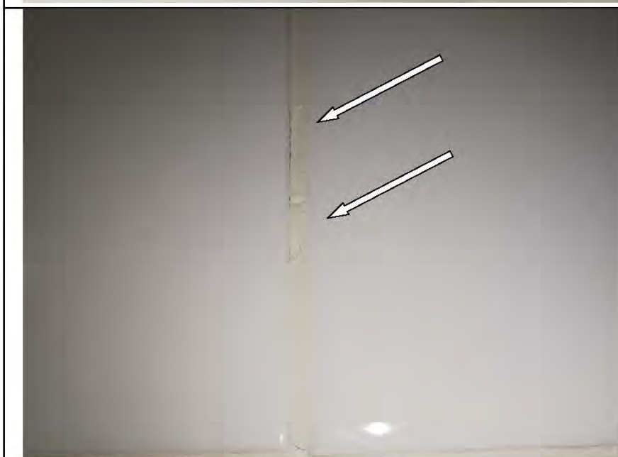
Фото №20. Затирка настенной плитки в санузле выполнена с нарушениями.
