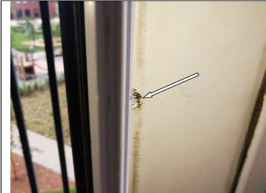
Фото №46. Скол на профиле ПВХ балконного блока в спальне.
