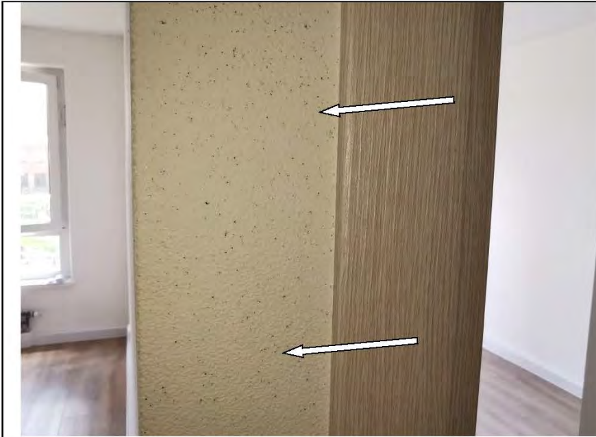
Фото №13. Загрязнение обойного полотна в коридоре.
