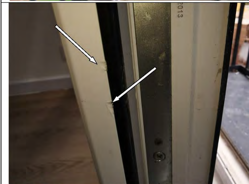
Фото №47. Скол на профиле ПВХ балконного блока в спальне.
