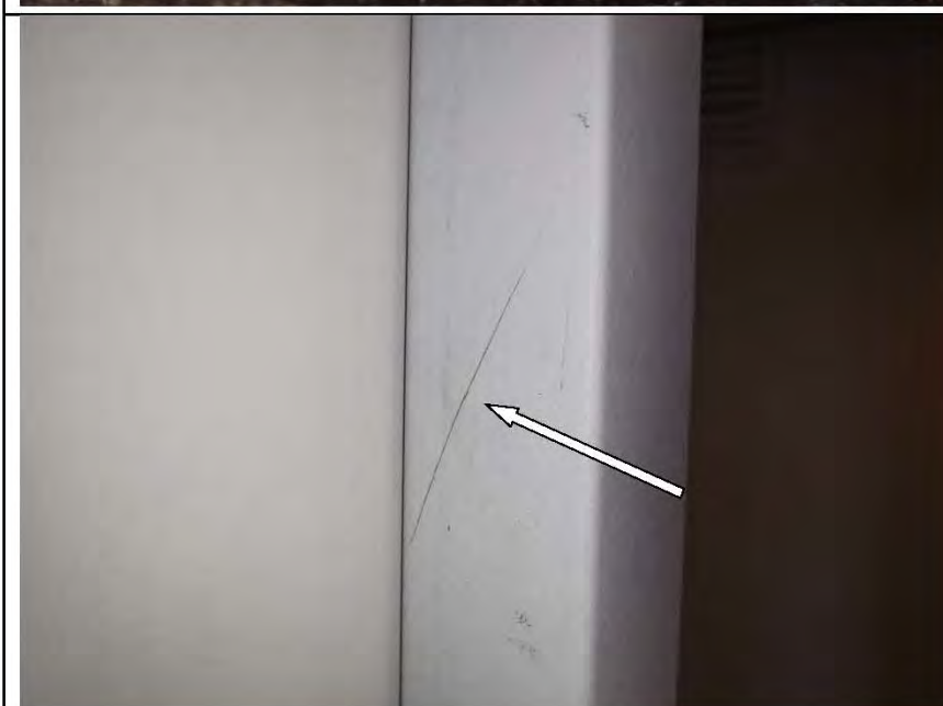
Фото №56. Царапины на коробе входного дверного блока.
