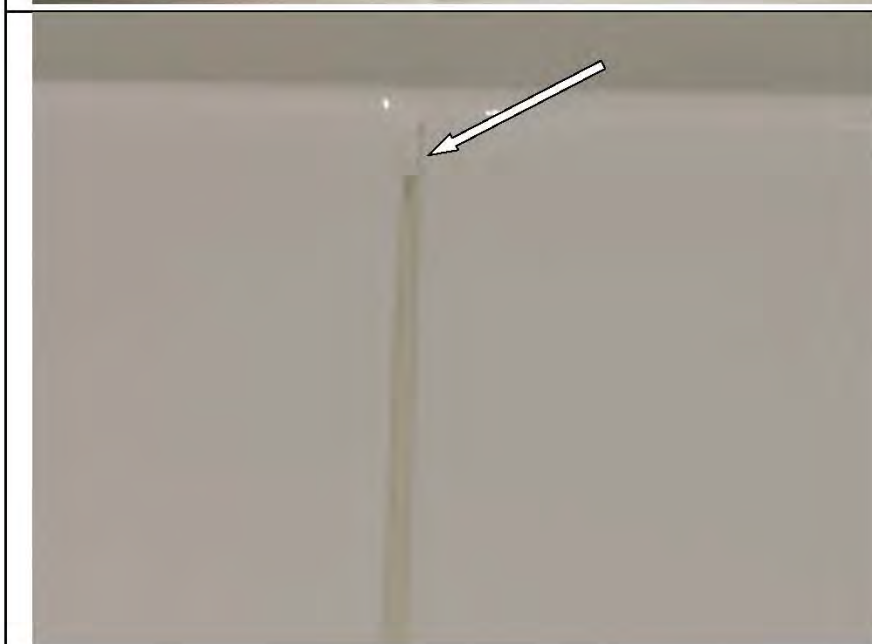
Фото №21. Затирка настенной плитки в санузле выполнена с нарушениями.
