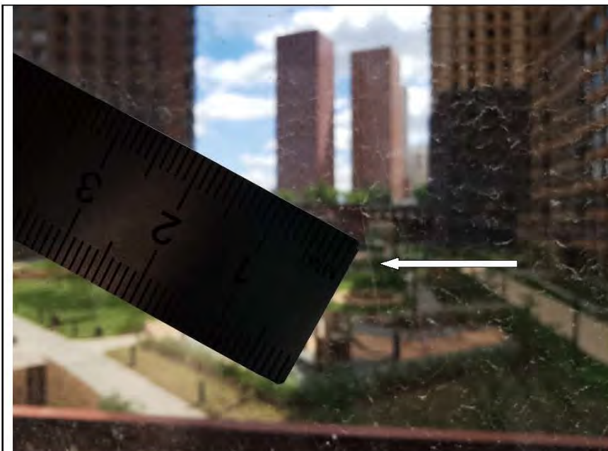
Фото №55. Царапины на стеклопакете оконного блока ПВХ в кухне.
