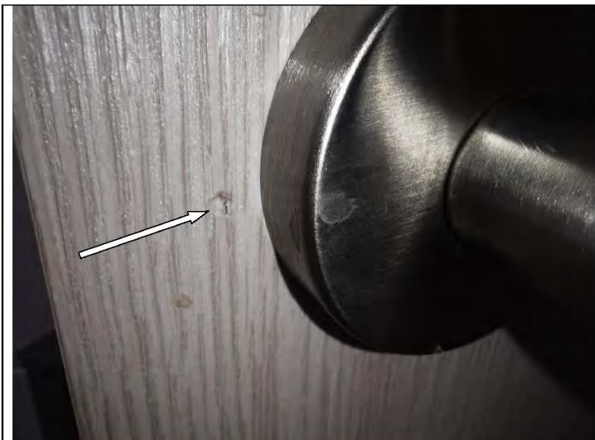
Фото №64. Повреждение ламинации полотна деревянного дверного блока в санузле.
