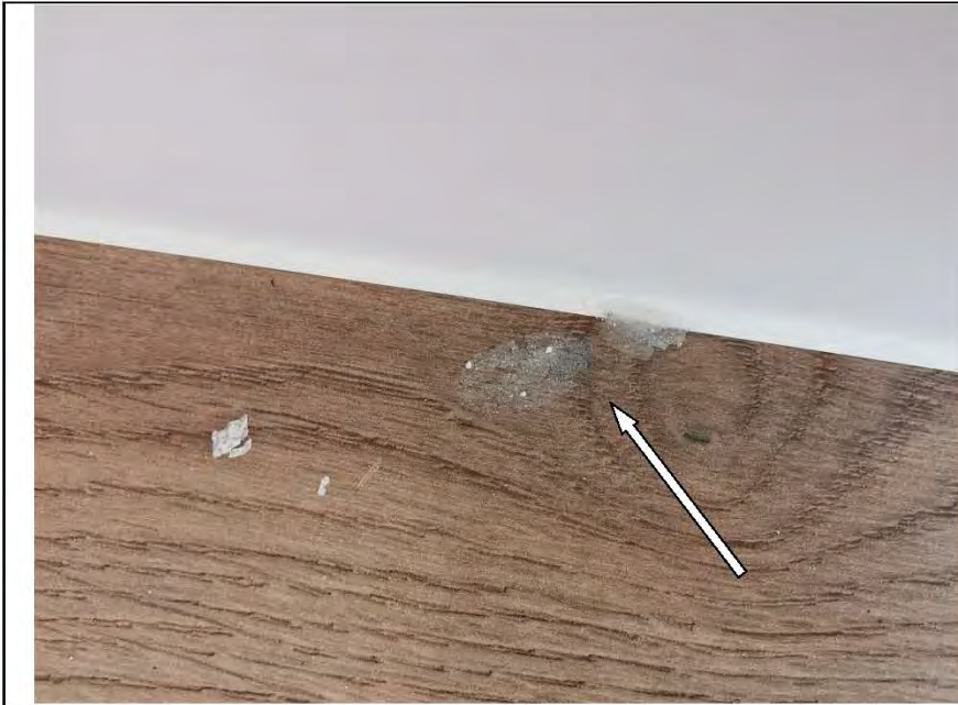
Фото №34. Загрязнение ламината в кухне.
