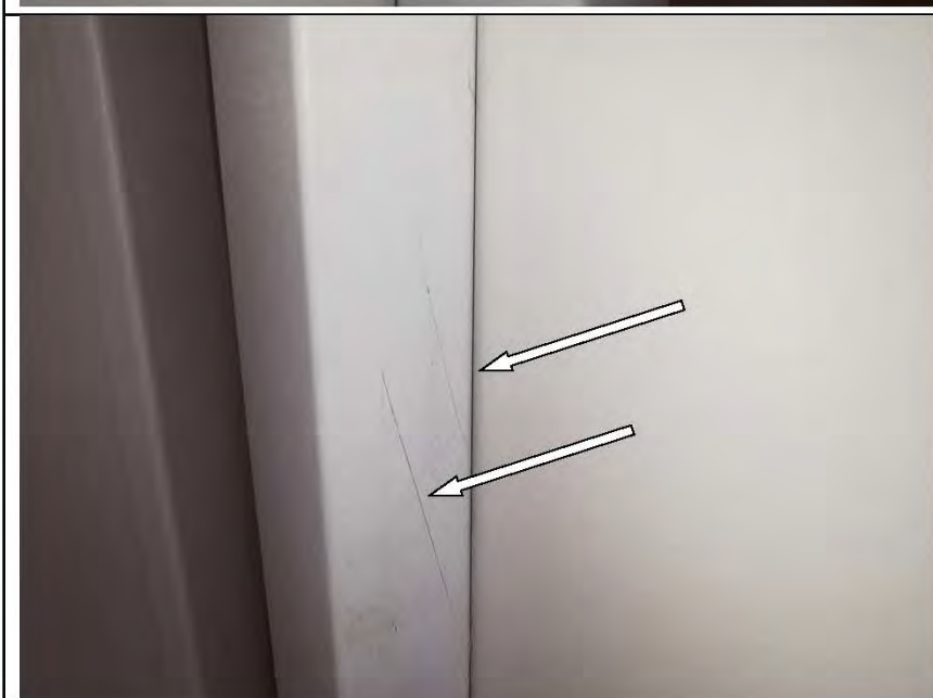
Фото №57. Царапины на коробе входного дверного блока.
