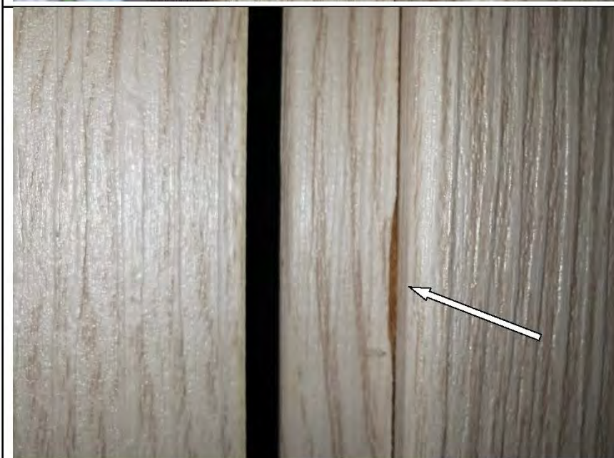
Фото №66. Повреждение ламинации короба деревянного дверного блока в спальне.
