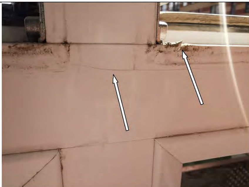
Фото №50. Царапины и сколы на профиле ПВХ оконного блока в кухне.
