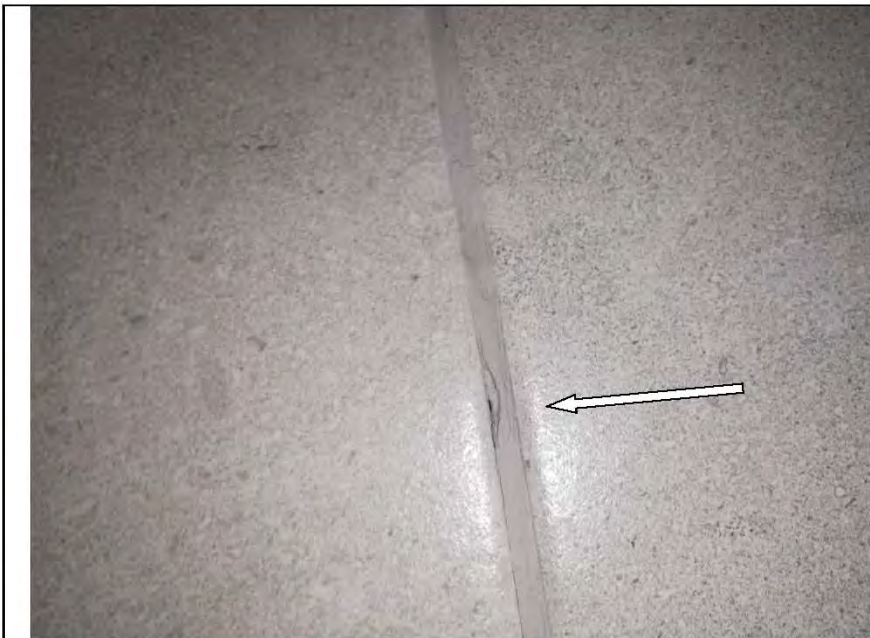
Фото №28. Затирка напольной плитки выполнена с нарушениями в санузле.
