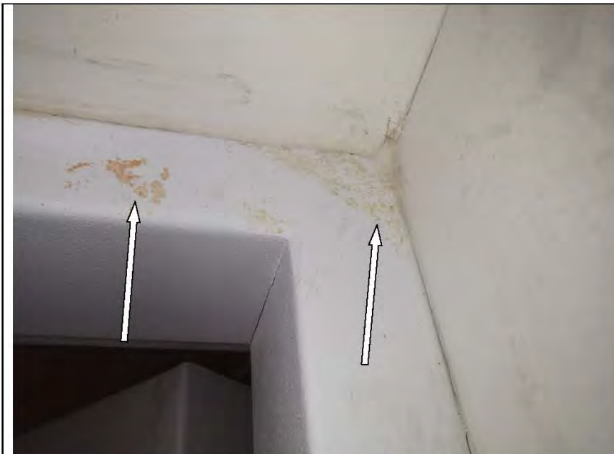
Фото №58. Загрязнения на коробе входного дверного блока.
