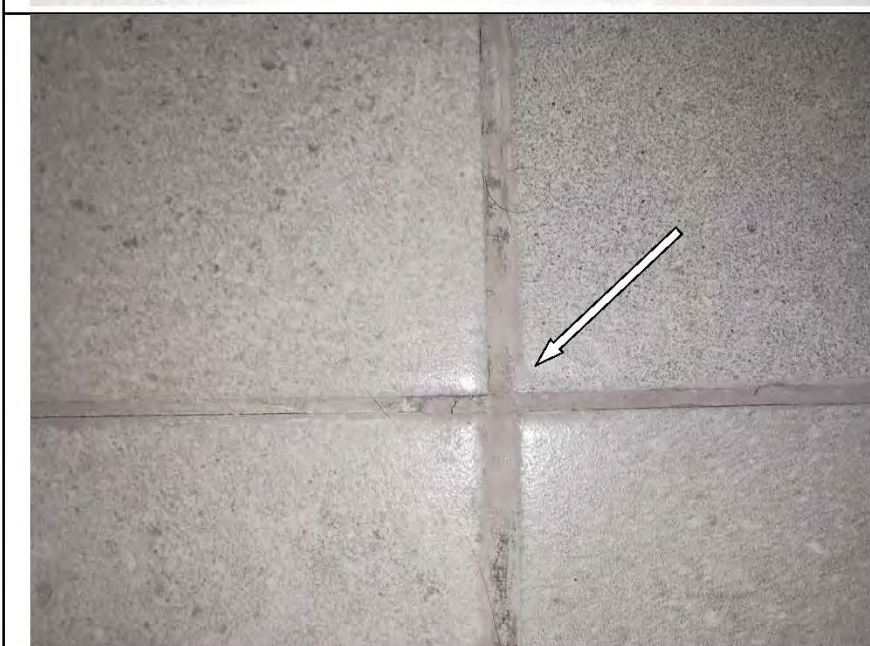
Фото №27. Затирка напольной плитки выполнена с нарушениями в санузле.
