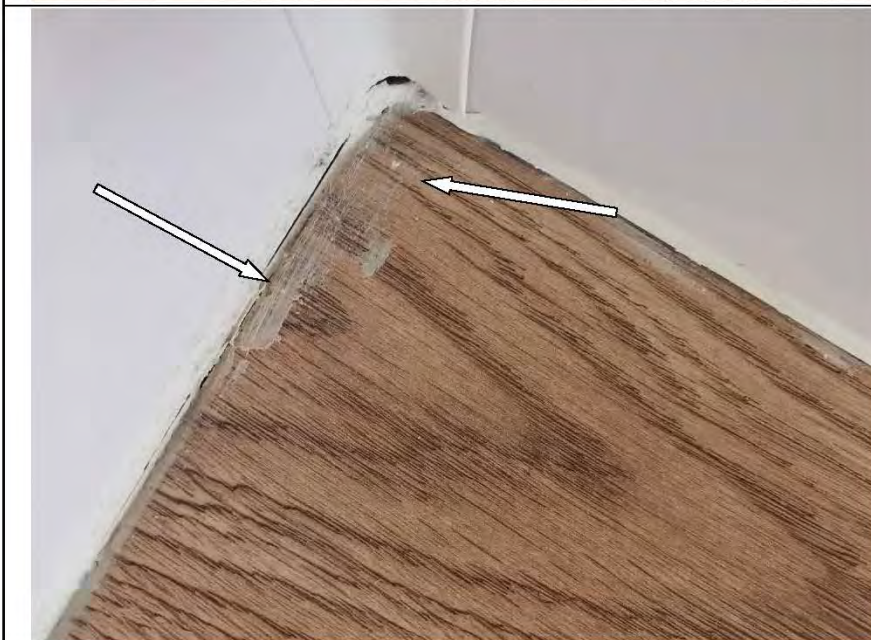
Фото №35. Загрязнение ламината в кухне.
