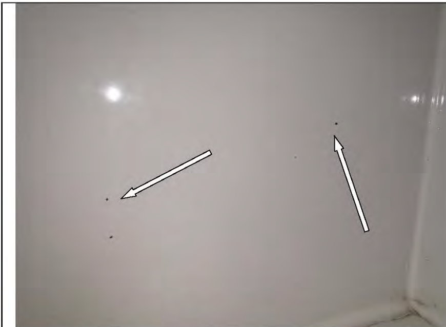
Фото №22. Окалины на настенной керамической плитке в санузле.
