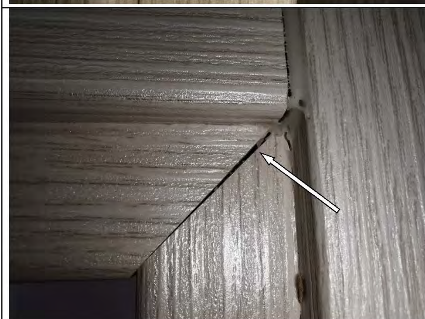
Фото №63. Ненадежное соединение элементов короба деревянного дверного блока в санузле.
