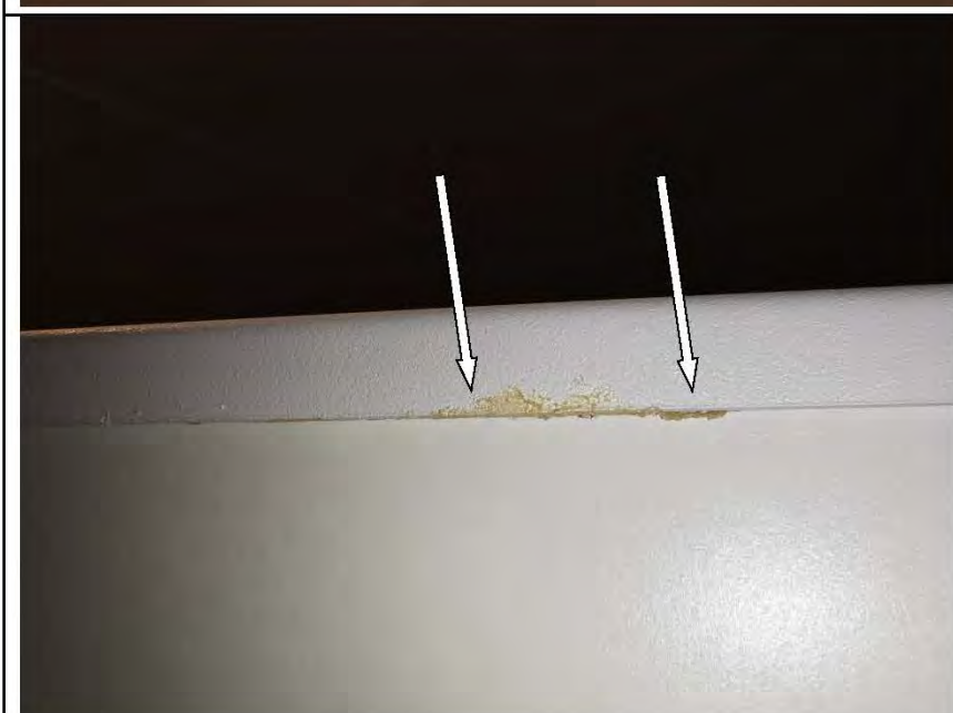
Фото №60. Загрязнения на полотне входного дверного блока.
