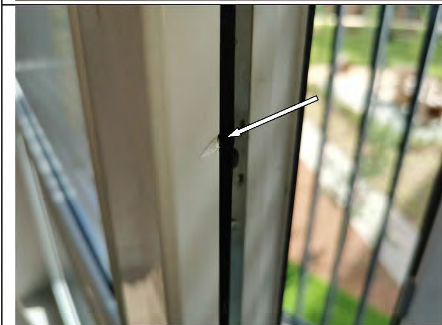
Фото №45. Скол на профиле ПВХ балконного блока в спальне.
