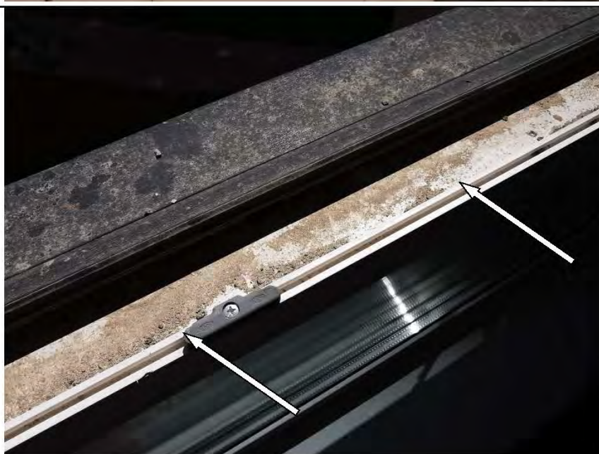
Фото №51. Загрязнение профиля ПВХ в кухне.
