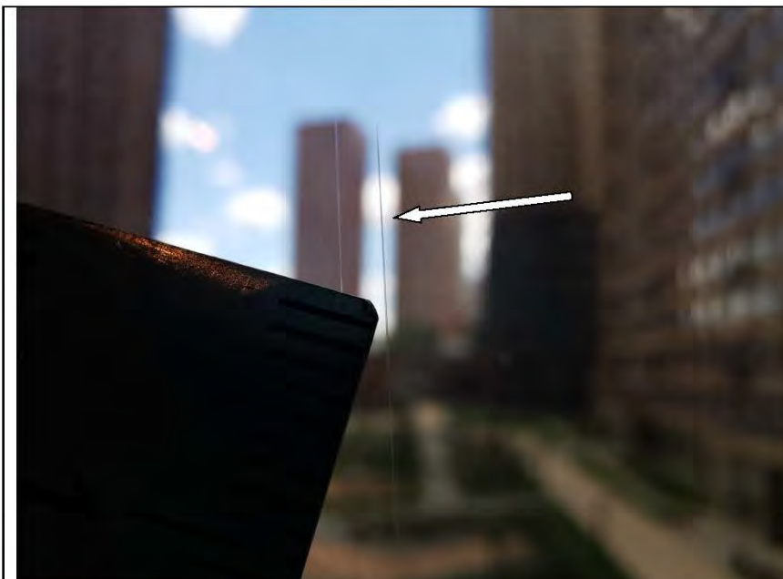
Фото №52. Царапины на стеклопакете ПВХ балконного блока в спальне.
