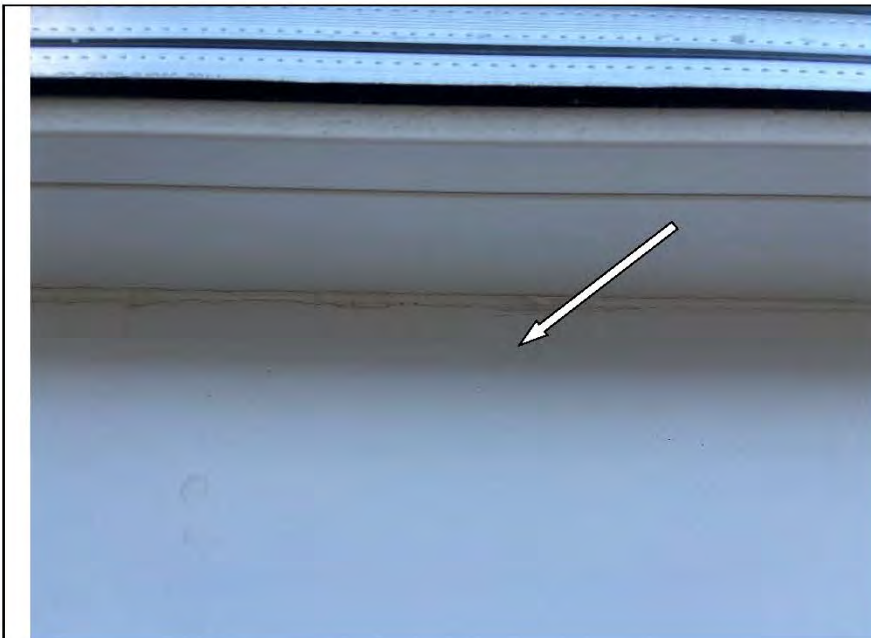
Фото №34. Дефект на лицевой стороне подоконной доски в спальне.
