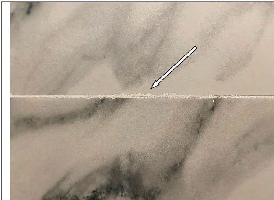
Фото №13. Сколы на настенной керамической плитке в ванной комнате.
