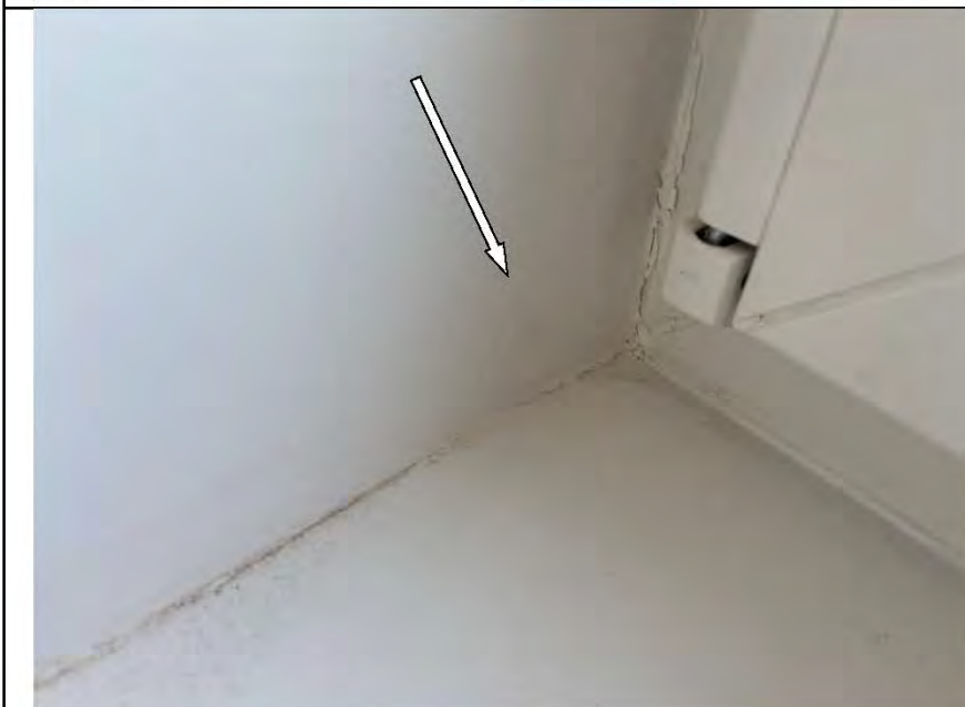
Фото №41. Неровности, выбоины, раковины на окрашенных откосах оконного блока ПВХ в спальне.
