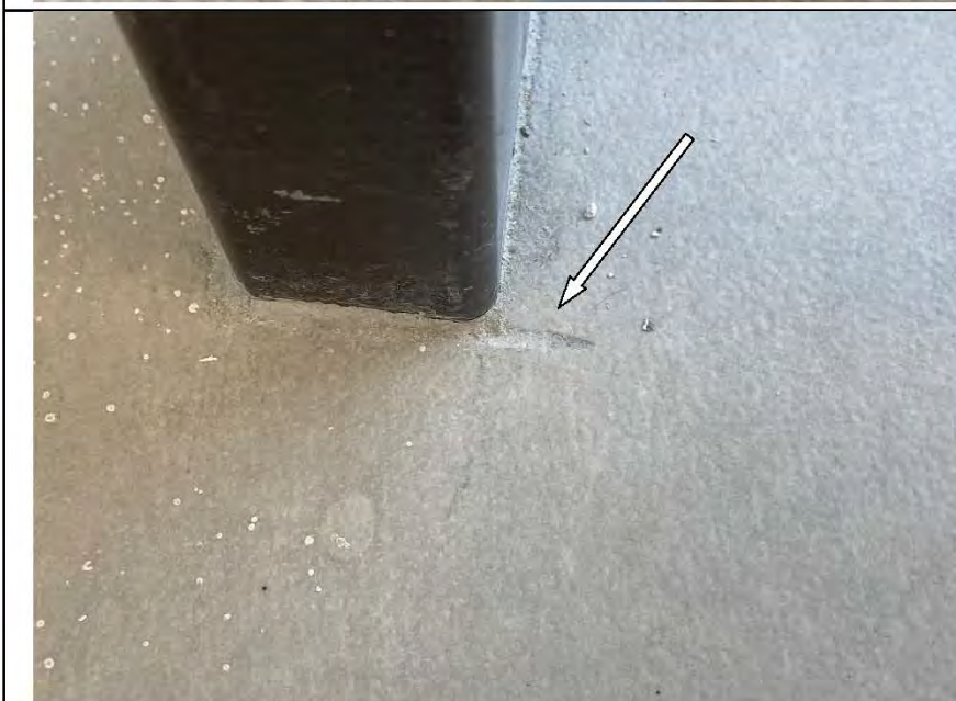
Фото №33. Дефект на поверхности напольного покрытия из керамической плитки на лоджии.
