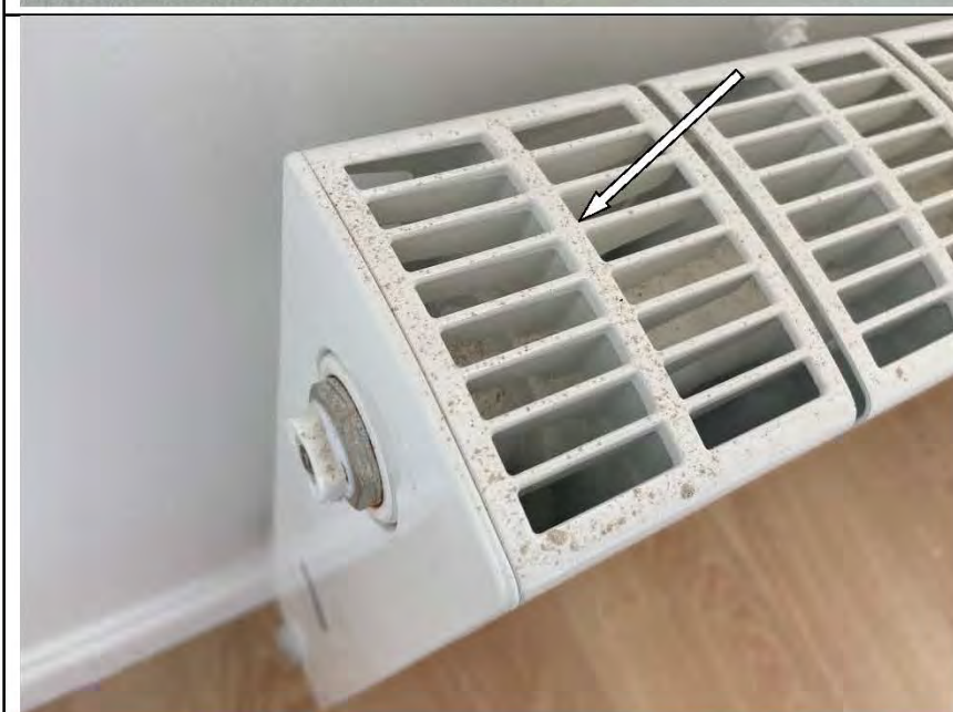
Фото №69. Загрязнения на металлическом кожухе отопительного прибора в спальне.
