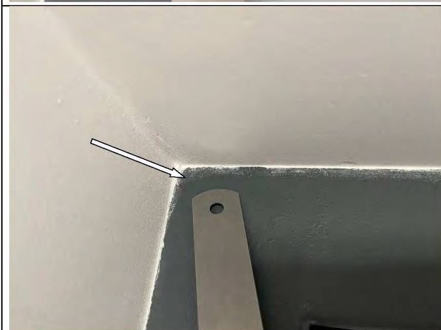
Фото №50. Дефект на коробке входного дверного блока в коридоре.
