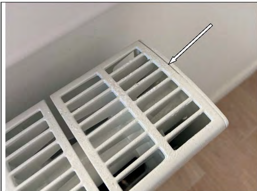
Фото №70. Загрязнения на металлическом кожухе отопительного прибора в кухне.
