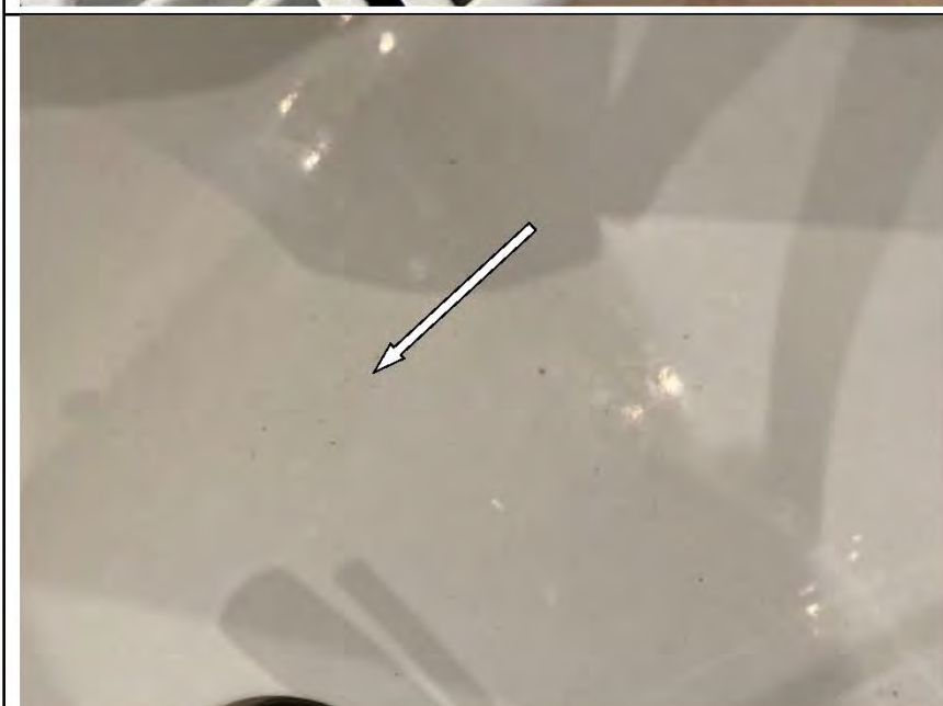
Фото №71. Дефект на ванне в ванной комнате.
