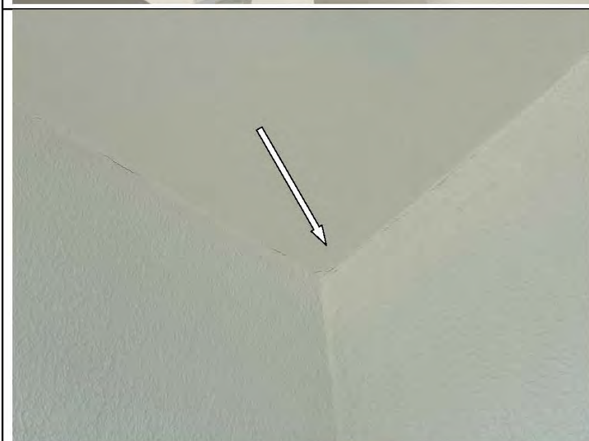
Фото №68. Дефект на поверхности подвесного потолка на лоджии.
