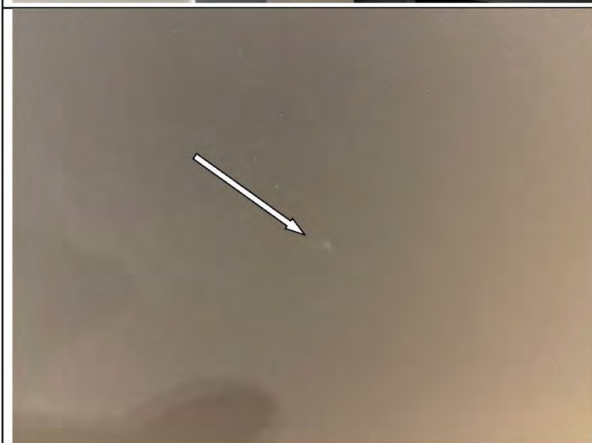
Фото №51. Дефект на полотне входного дверного блока в коридоре.
