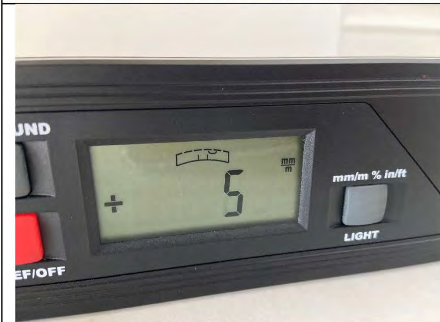
Фото №17. Отклонения поверхности напольного покрытия из керамической плитки в коридоре.
