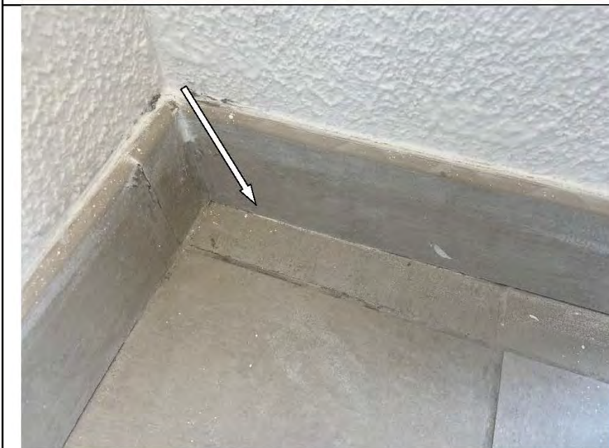
Фото №23. Загрязнения на напольной керамической плитке на лоджии.
