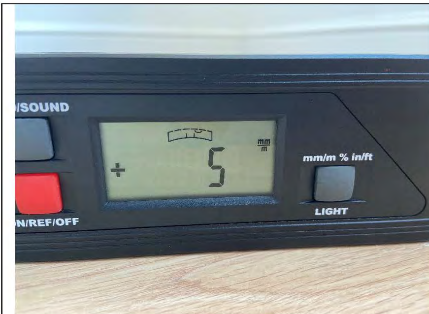
Фото №16. Отклонения поверхности напольного покрытия из ламината в спальне.
