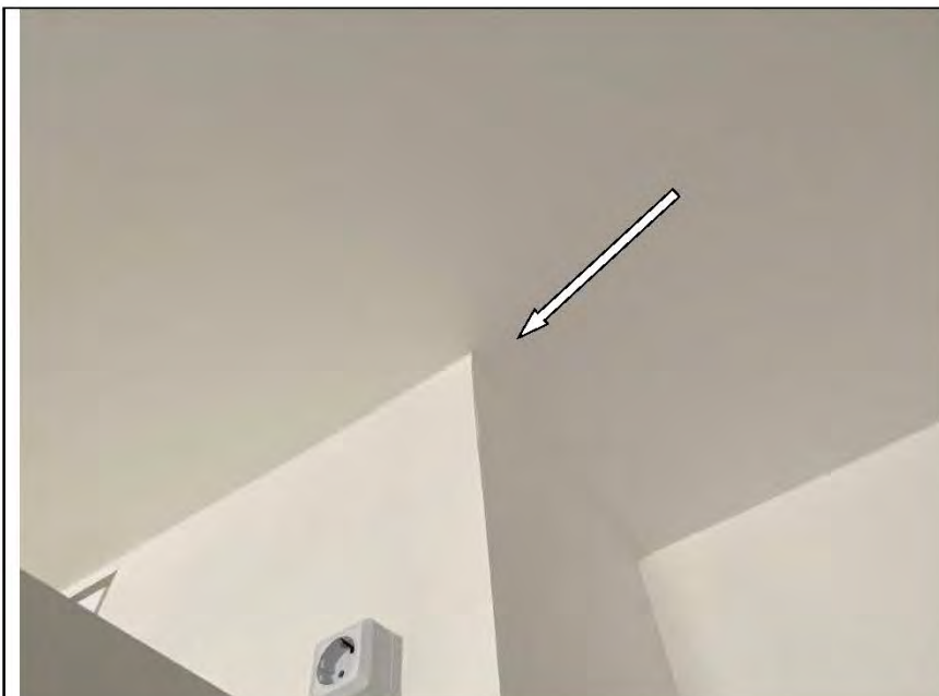
Фото №67. Дефект на поверхности подвесного потолка в кухне.
