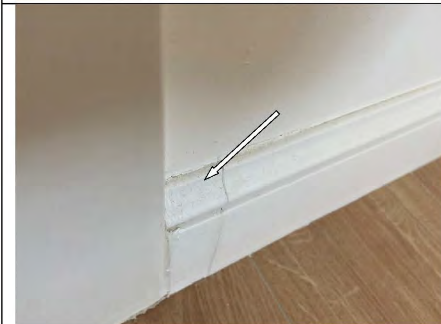
Фото №29. Дефект на напольном деревянном плинтусе в спальне.
