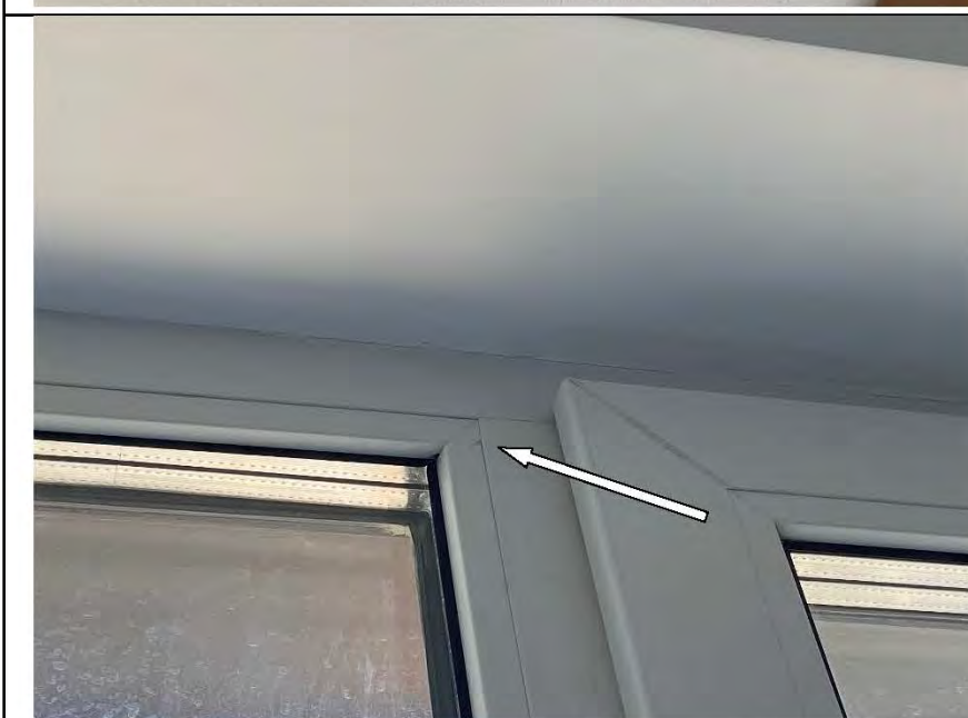
Фото №36. Дефект на профиле оконного блока ПВХ в спальне.
