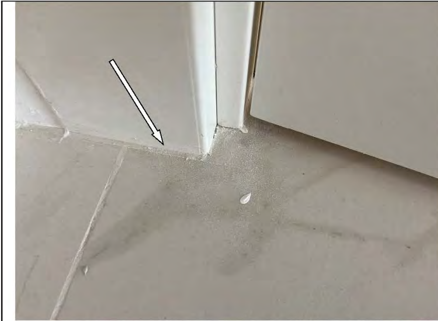
Фото №22. Загрязнения на напольной керамической плитке в кухне.
