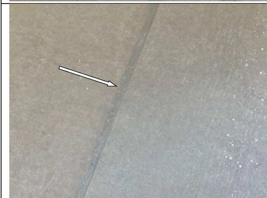
Фото №27. Неровные швы напольной керамической плитки на лоджии.
