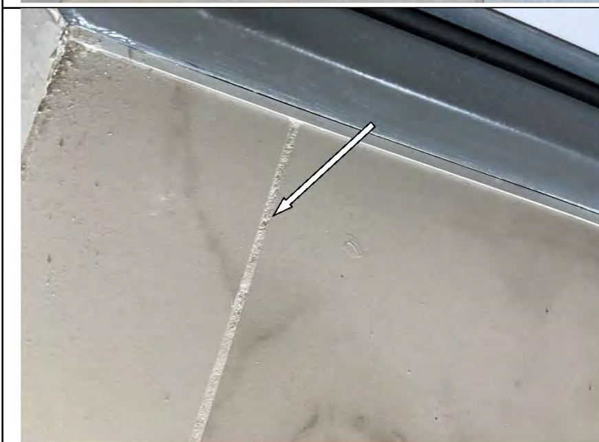
Фото №24. Неровные швы напольной керамической плитки в коридоре.
