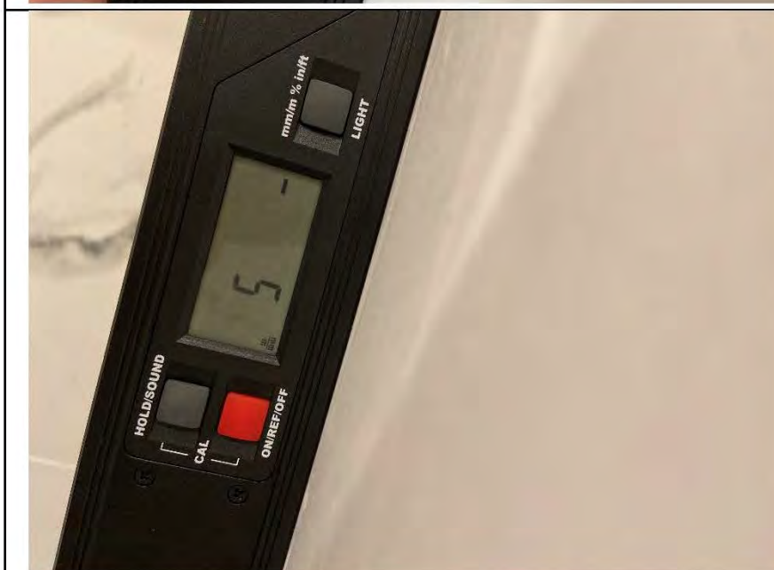
Фото №11. Отклонения поверхности стен от вертикали в ванной комнате.
