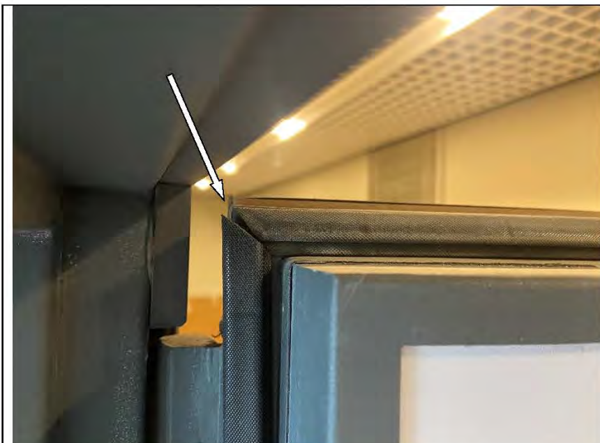
Фото №61. Дефект на уплотнительной противопожарной ленте входного дверного блока в коридоре.
