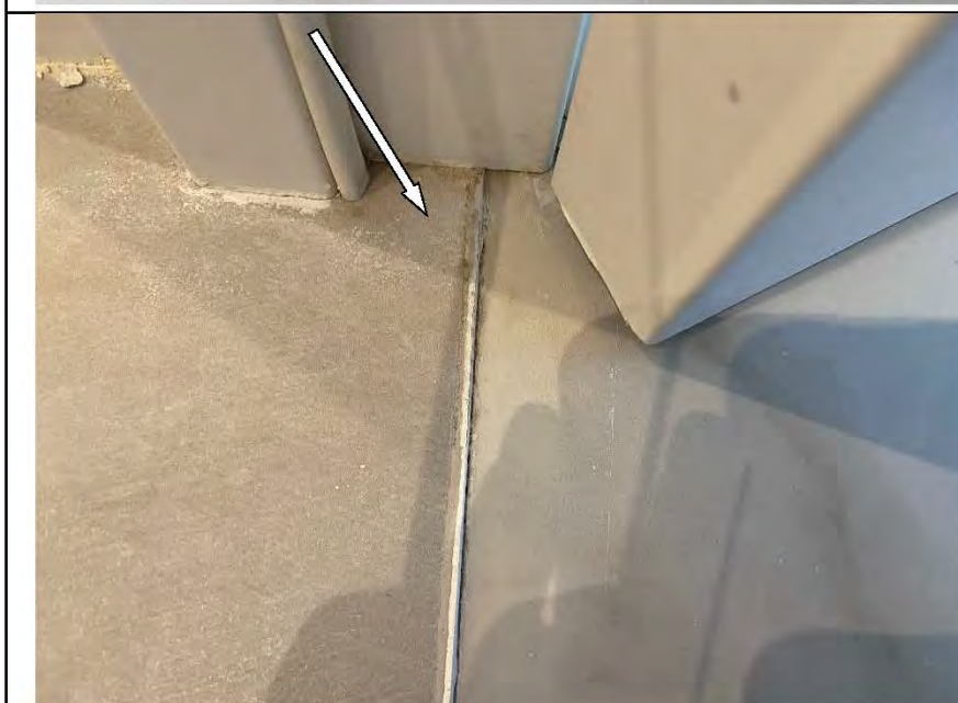
Фото №21. Загрязнения на напольной керамической плитке в ванной комнате.
